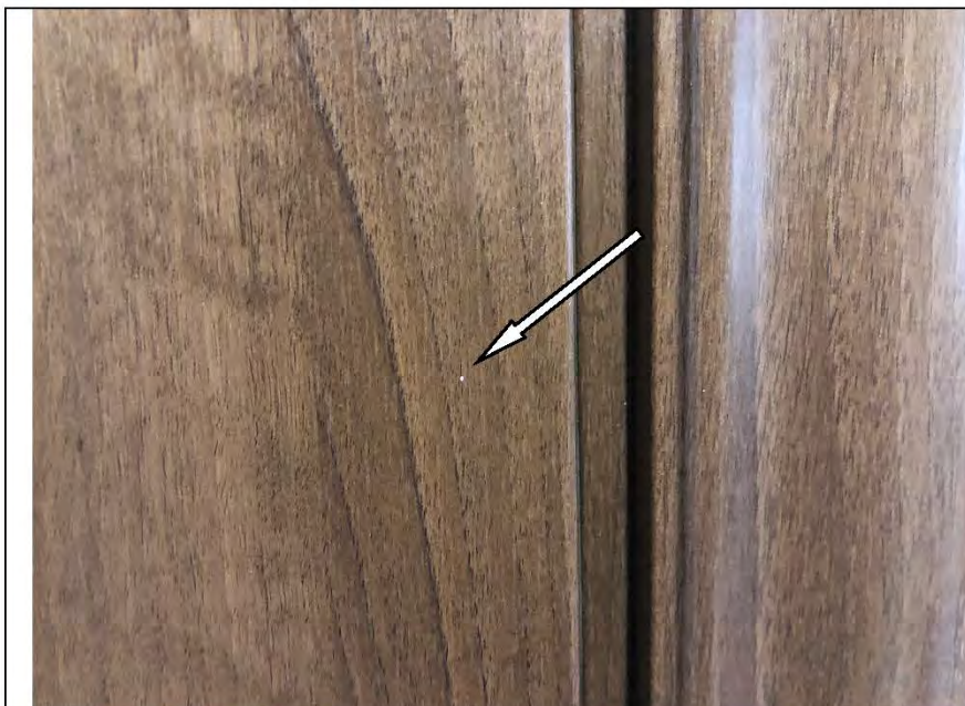
Фото №34. Загрязнения на полотне деревянного дверного блока в ванной комнате в квартире.
