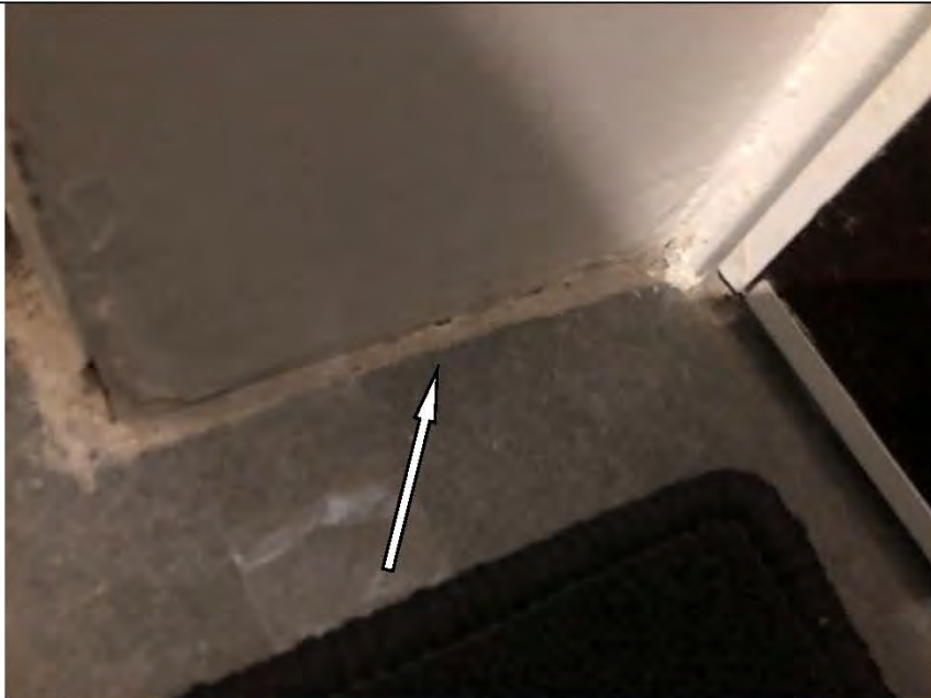
Фото №16. Частично не хватает напольной керамической плитки в коридоре в квартире.
