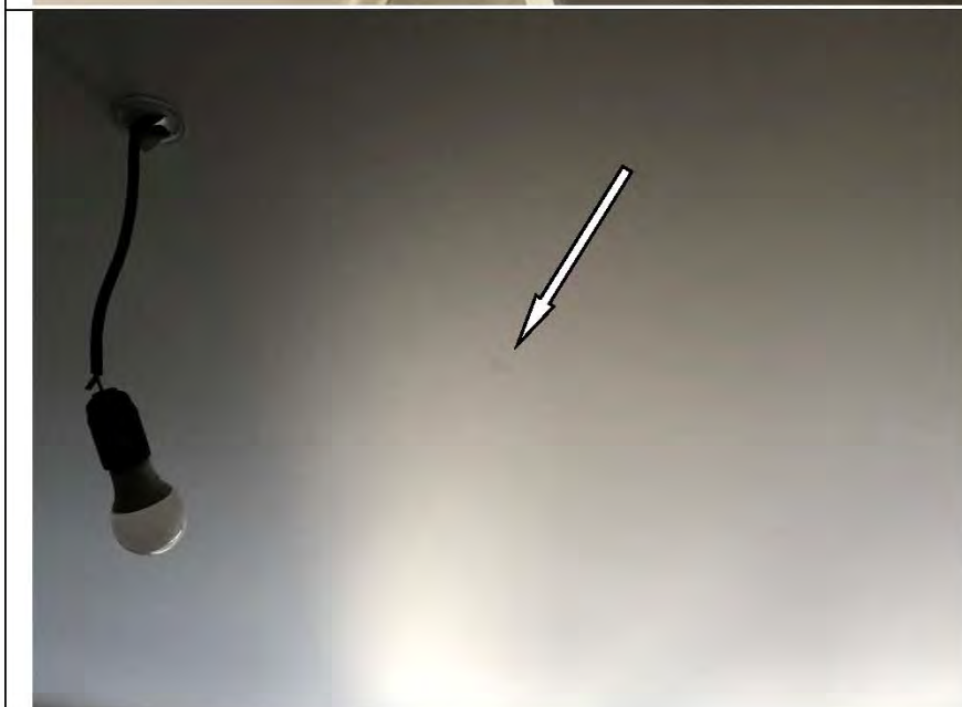
Фото №27. Загрязнения на полотне натяжного потолка в спальне в квартире.
