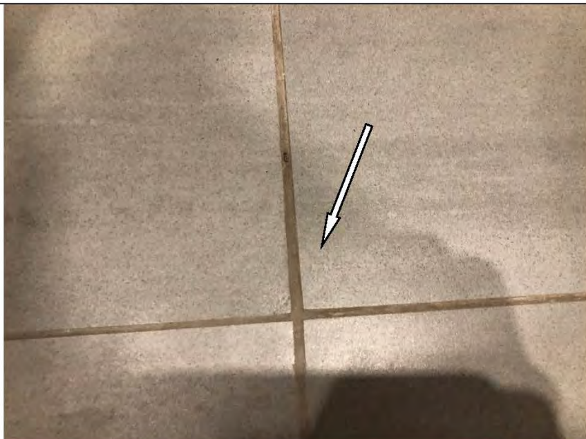
Фото №22. Неровный шов напольной керамической плитки в ванной комнате в квартире.
