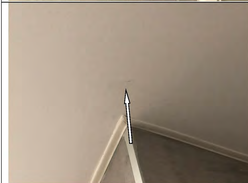
Фото №26. Загрязнения на полотне натяжного потолка в ванной комнате в квартире.
