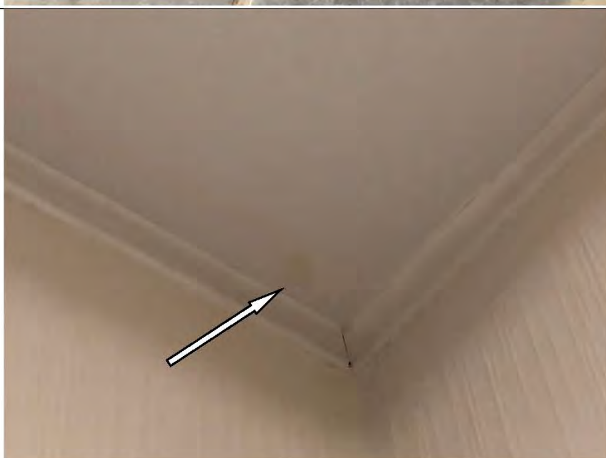
Фото №24. Загрязнения на полотне натяжного потолка в коридоре в квартире.
