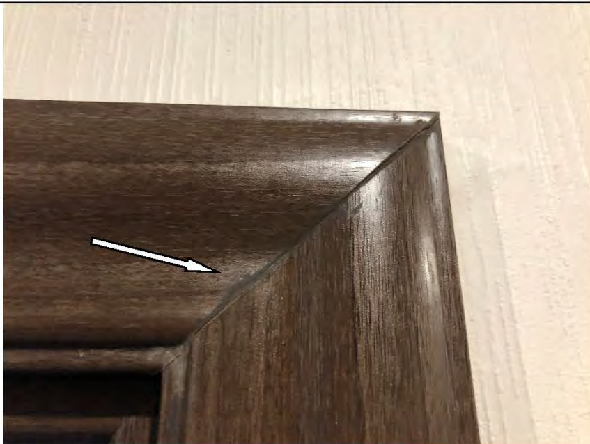
Фото №32. Загрязнения на наличнике деревянного дверного блока в кухне в квартире.
