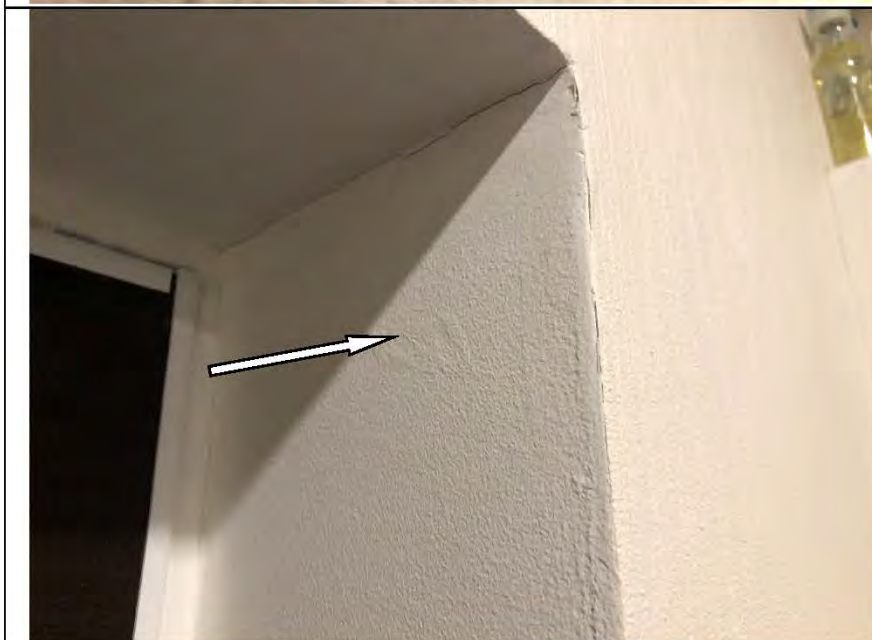
Фото №14. Неровности, сколы на окрашенных откосах входной двери в коридоре в квартире.
