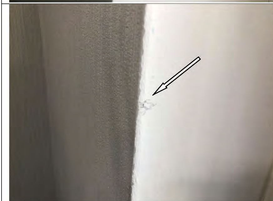
Фото №48. Неровности, сколы на окрашенных откосах оконного блока ПВХ в кухне в квартире.
