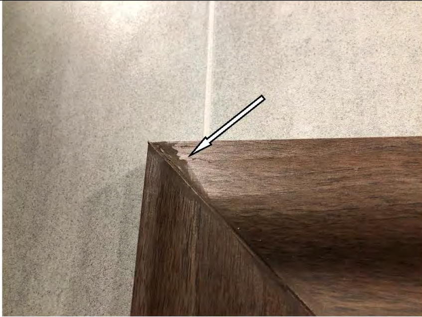
Фото №31. Загрязнения на наличнике деревянного дверного блока в ванной комнате в квартире.
