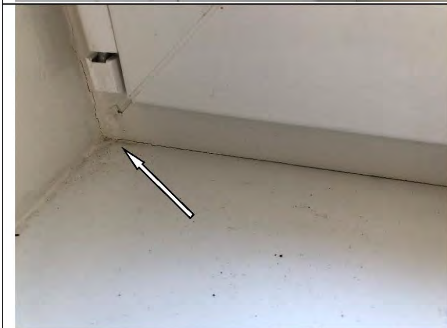
Фото №53. Инфильтрация оконного блока ПВХ в детской в квартире.
