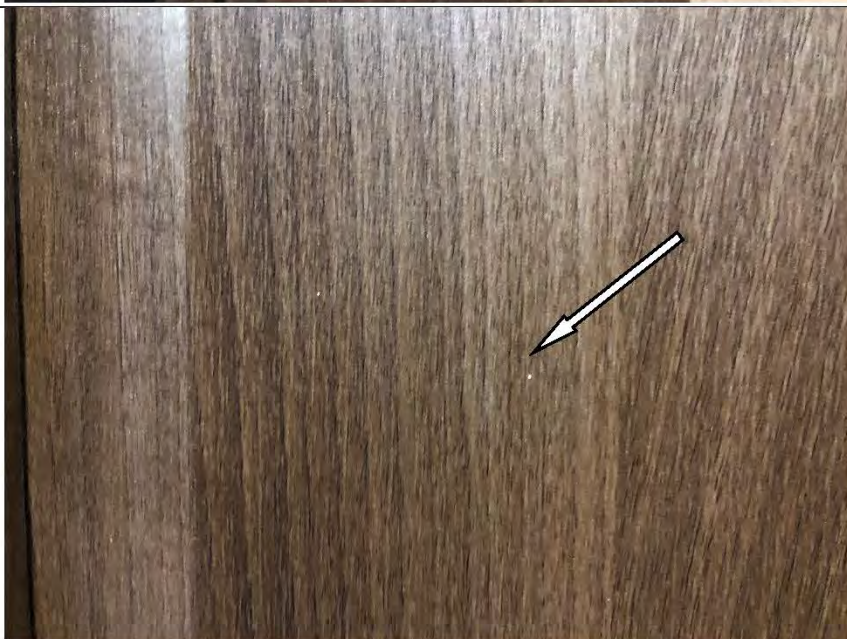
Фото №33. Загрязнения на полотне деревянного дверного блока в санузле в квартире.
