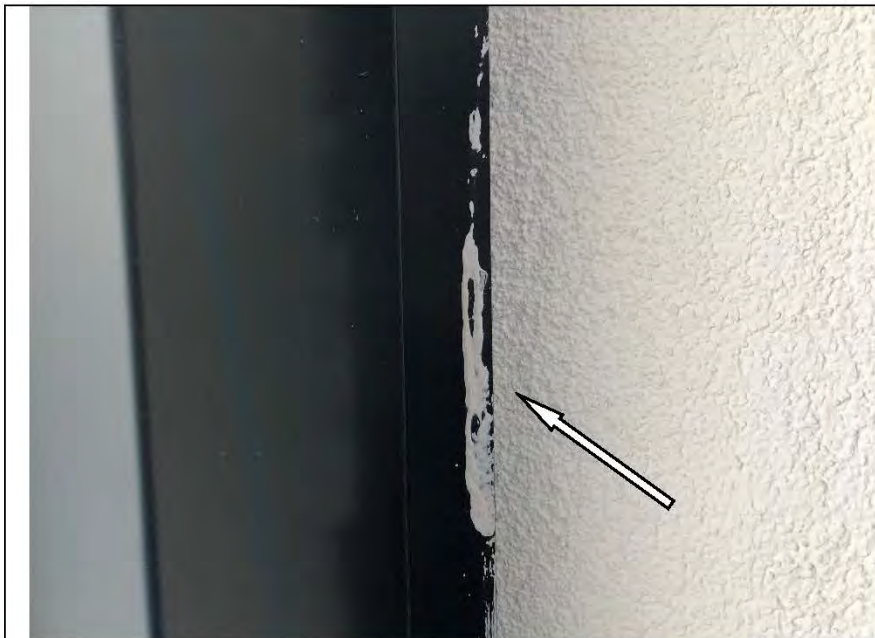
Фото №67. Загрязнения на металлическом профиле оконного блока на лоджии в квартире.
