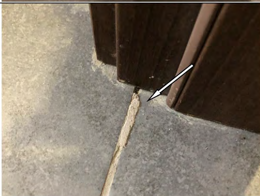
Фото №23. Неровный шов напольной керамической плитки в кухне в квартире.
