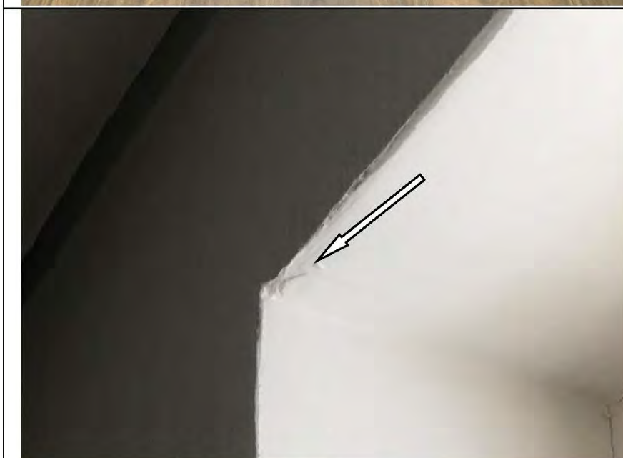
Фото №47. Неровности, сколы на окрашенных откосах оконного блока ПВХ в спальне в квартире.
