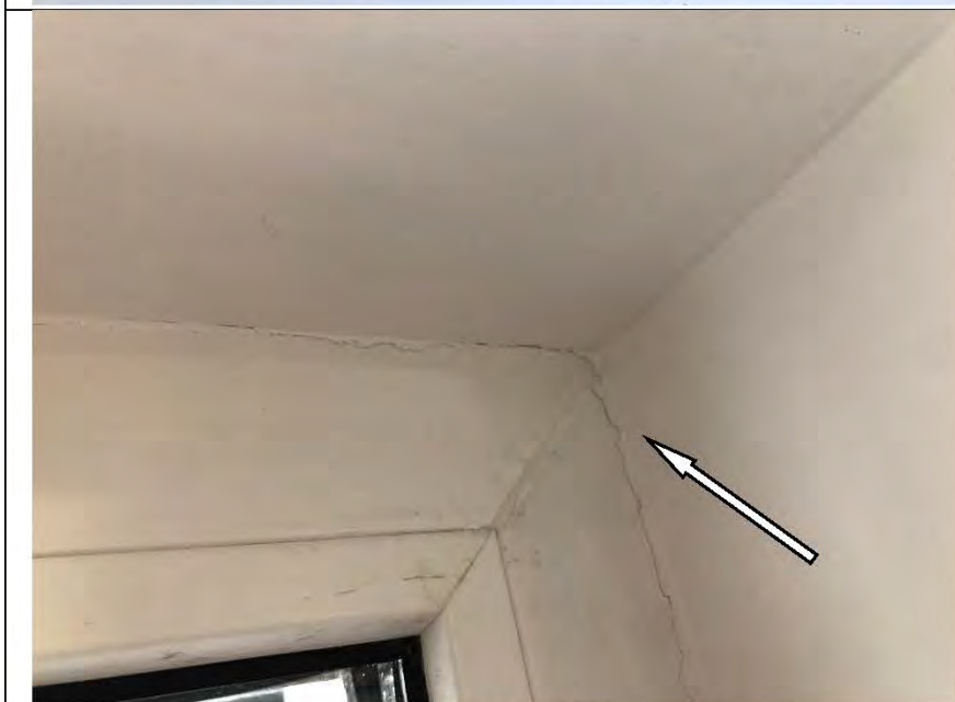
Фото №54. Инфильтрация оконного блока ПВХ в кухне в квартире.
