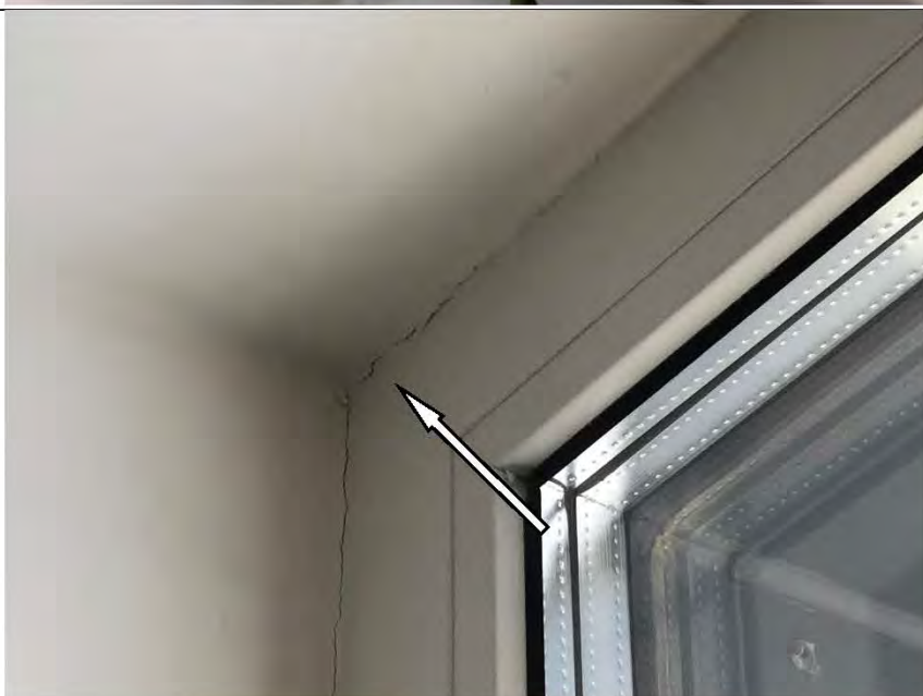
Фото №51. Инфильтрация оконного блока ПВХ в спальне в квартире.
