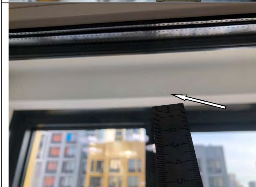
Фото №59. Царапины на стеклопакете оконного блока ПВХ в кухне в квартире.
