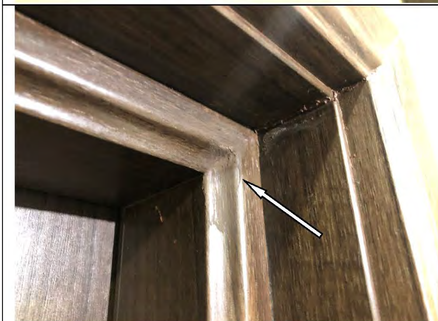
Фото №65. Загрязнения на коробке деревянного дверного блока в ванной комнате в квартире.
