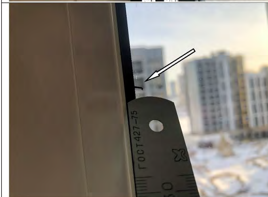
Фото №57. Окарины на стеклопакете оконного блока ПВХ в спальне в квартире.
