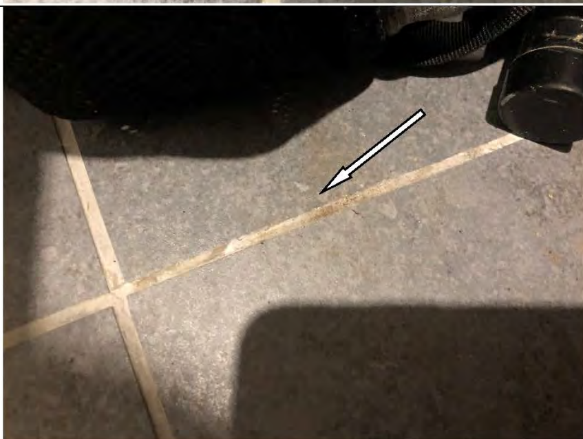
Фото №21. Неровный шов напольной керамической плитки в коридоре в квартире.
