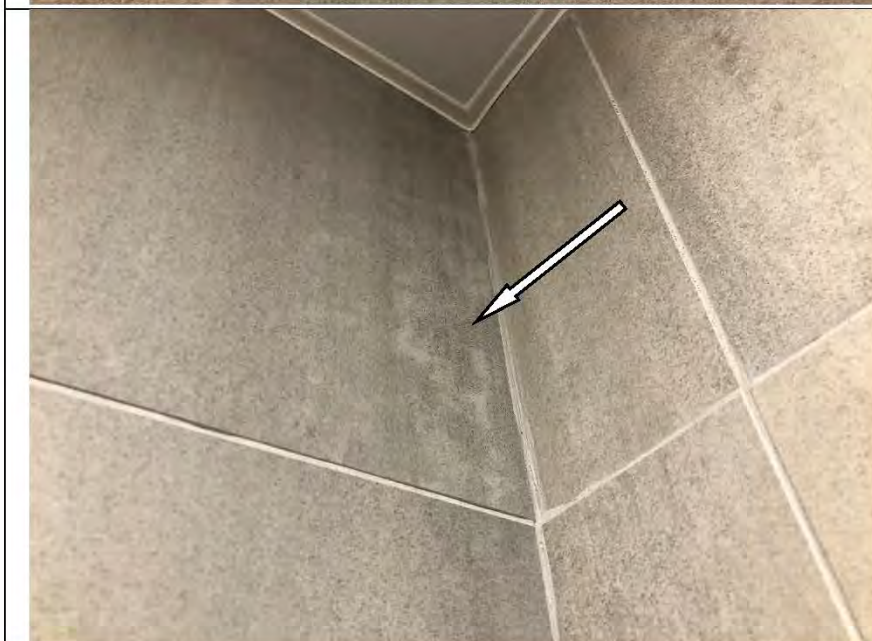
Фото №39. Загрязнения на настенной керамической плитке в санузле в квартире.
