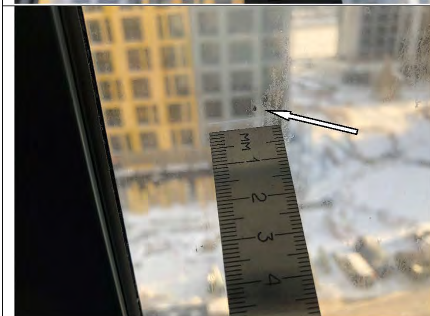
Фото №60. Царапины на стеклопакете оконного блока ПВХ на лоджии в квартире.
