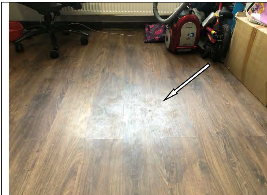
Фото №46. Загрязнения на ламинате в спальне в квартире.
