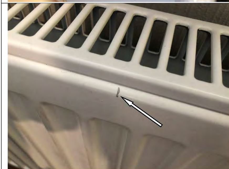
Фото №63. Загрязнения на кожухе отопительного прибора в спальне в квартире.
