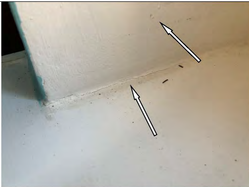
Фото №49. Неровности, сколы на окрашенных откосах оконного блока ПВХ и загрязнения на подоконной доске в детской в квартире.
