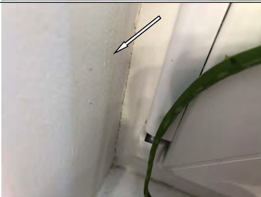
Фото №50. Неровности, сколы на окрашенных откосах оконного блока ПВХ в детской в квартире.
