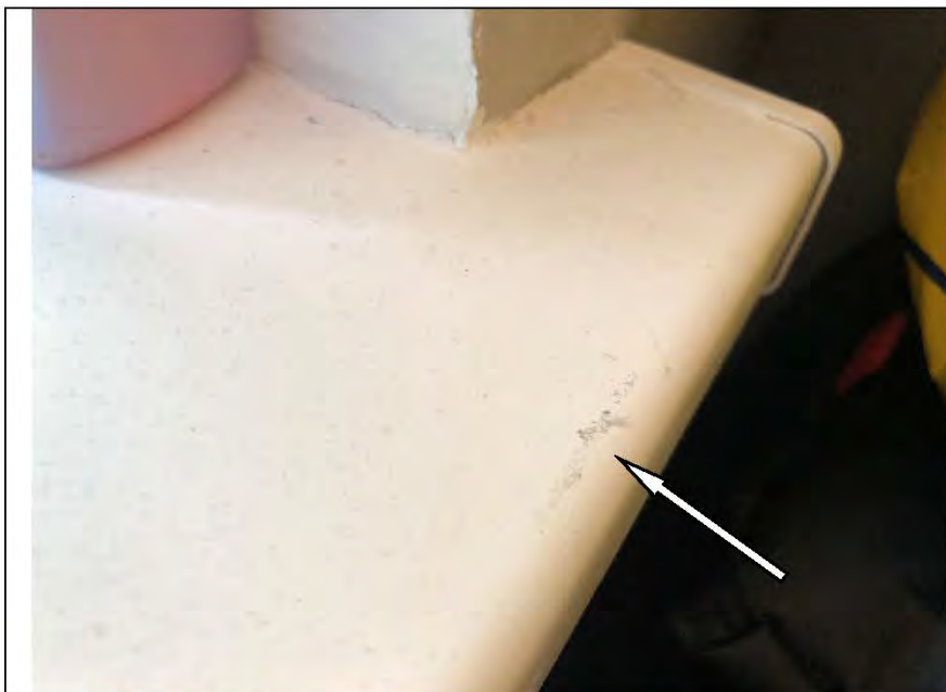
Фото №61. Загрязнения на подоконной доске в спальне в квартире.
