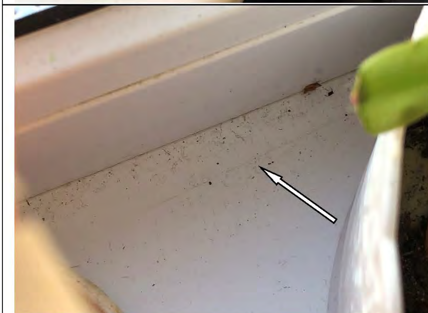
Фото №62. Царапина на подоконной доске в детской в квартире.
