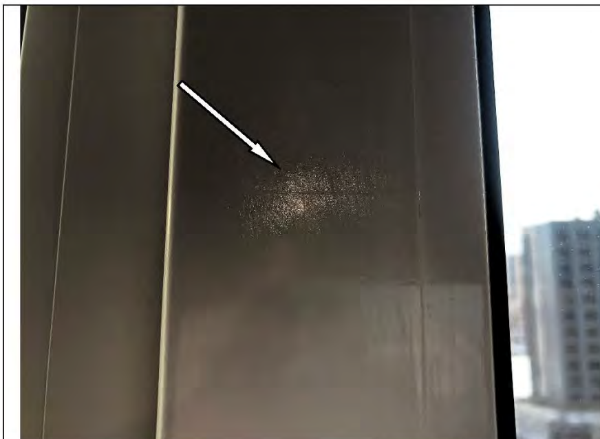
Фото №55. Царапина на профиле оконного блока ПВХ в спальне в квартире.
