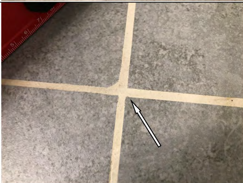
Фото №20. Загрязнения на напольной керамической плитке в кухне в квартире.
