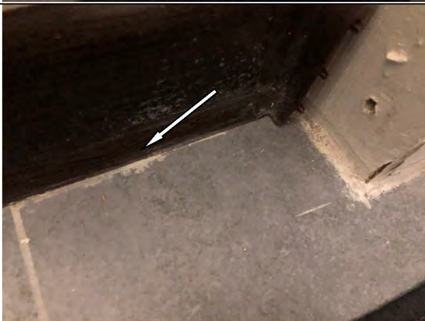
Фото №17. Загрязнения на напольной керамической плитке в коридоре в квартире.
