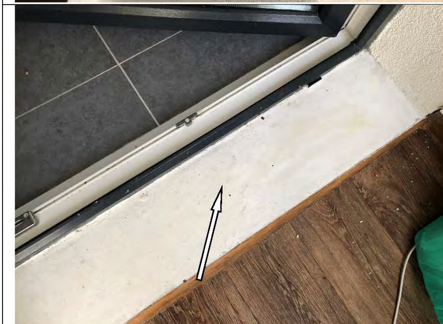
Фото №15. Неровности, сколы на окрашенных откосах дверного блока на лоджии в квартире.
