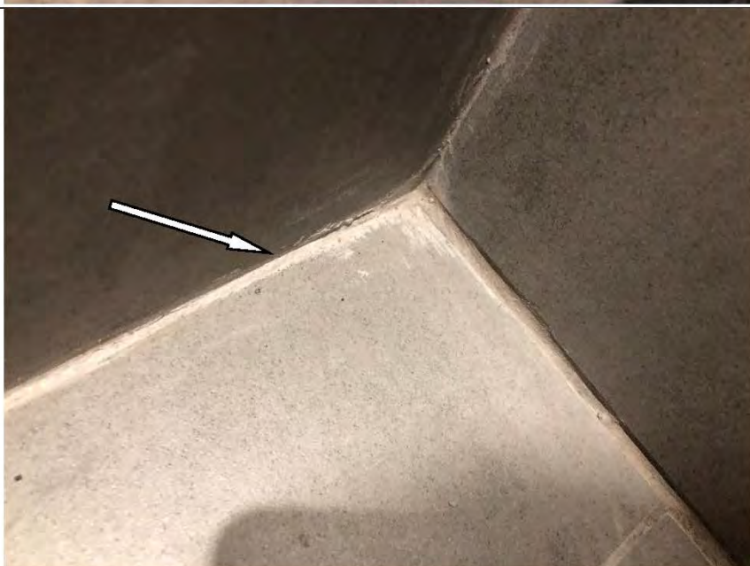
Фото №18. Загрязнения на напольной керамической плитке в санузле в квартире.
