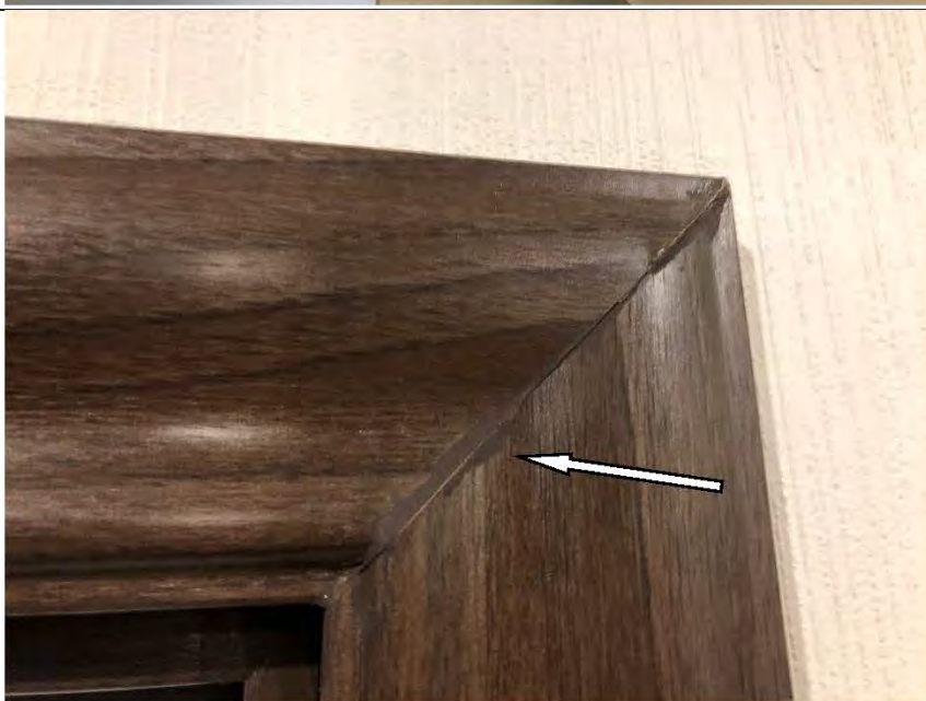
Фото №30. Загрязнения на наличнике деревянного дверного блока в санузле в квартире.
