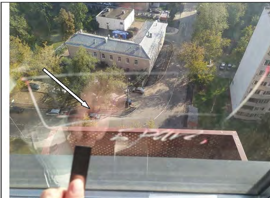
Фото №22. На стеклопакете оконного блока ПВХ в кухне имеется дефект (брак).
