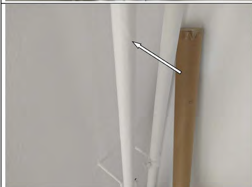
Фото №45. Окрашивание труб отопления выполнено с дефектами (подтеки) в спальне
