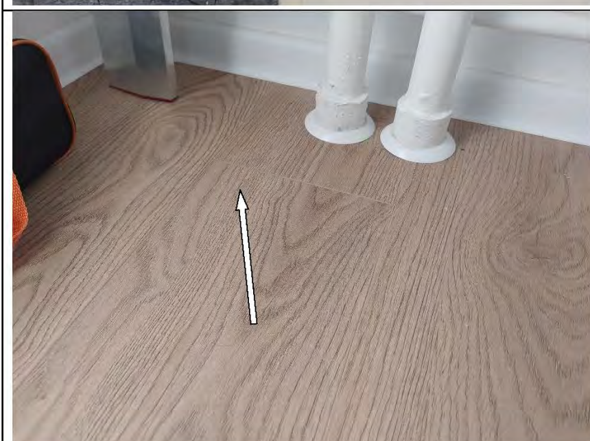
Фото №35. Вздутие ламината в кухне.
