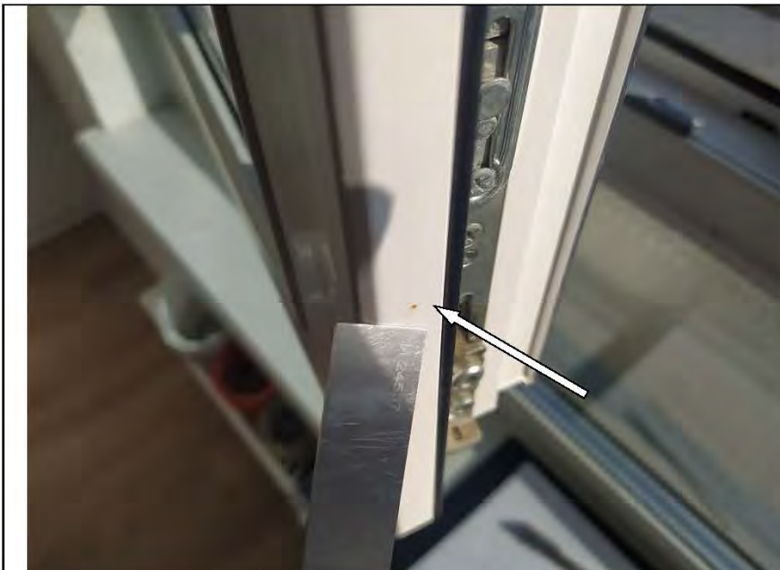
Фото №16. Профиль ПВХ оконного блока в спальне имеет дефекты (окалина).
