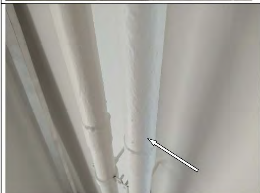
Фото №44. Окрашивание труб отопления выполнено с дефектами (подтеки) в кухне
