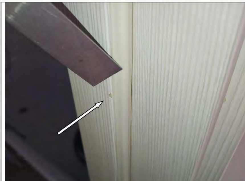
Фото №28. Коробка деревянного дверного блока в ванной комнате имеет дефекты (сколы).
