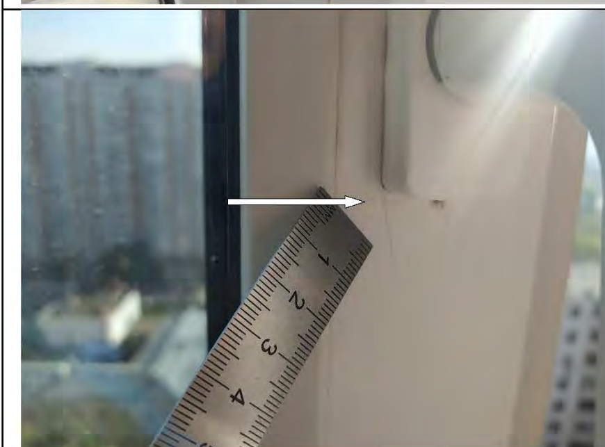
Фото №21. Профиль ПВХ оконного блока в кухне имеет дефекты (царапины).
