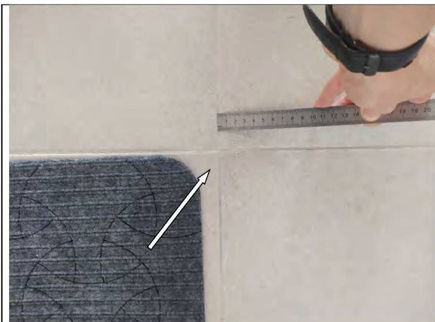
Фото №34. Затирка напольной плитки выполнена с нарушениями в кухне: разность ширины шва.
