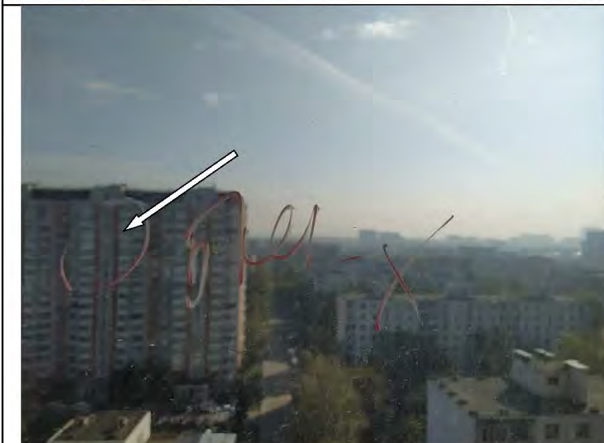
Фото №23. На стеклопакете оконного блока ПВХ в спальне имеется дефект (окалина).
