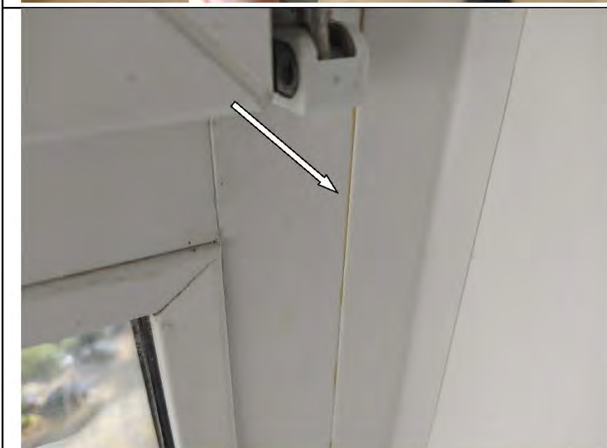
Фото №20. Профиль ПВХ оконного блока в кухне имеет дефекты (загрязнение строительными составами).
