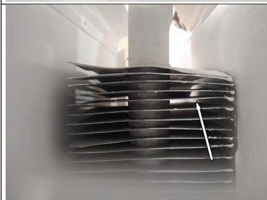
Фото №41. Радиатор в спальне имеет дефекты (замятия)
