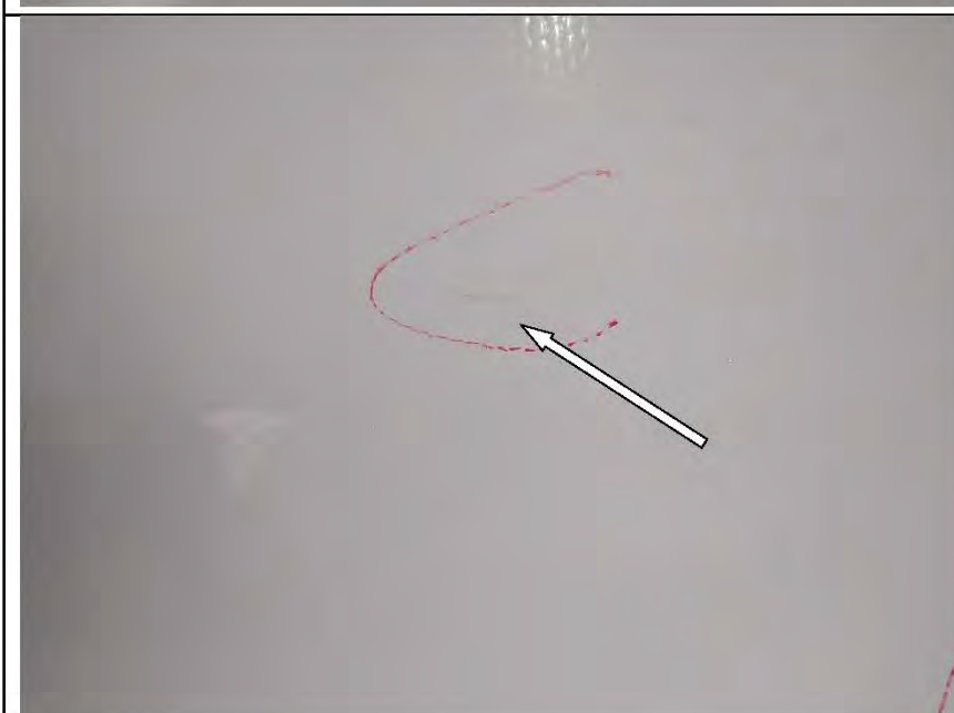
Фото №42. Ванная имеет дефекты (механическое повреждение)
