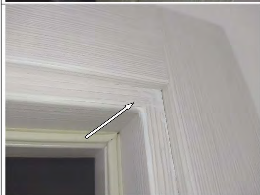
Фото №29. Коробка деревянного дверного блока в ванной комнате имеет дефекты (загрязнение малярными составами).
