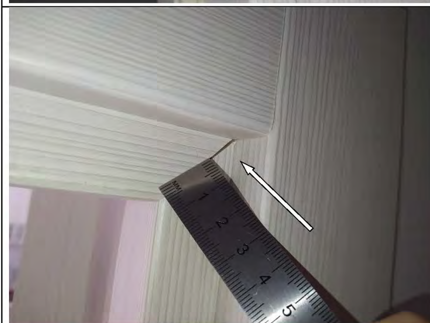
Фото №30. Элементы дверного блока (коробка) соединены не надежно в ванной комнате
