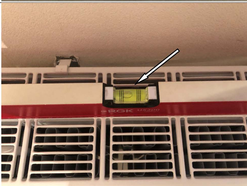
Фото №33. Неровно смонтирован отопительный прибор в кухне в квартире.
