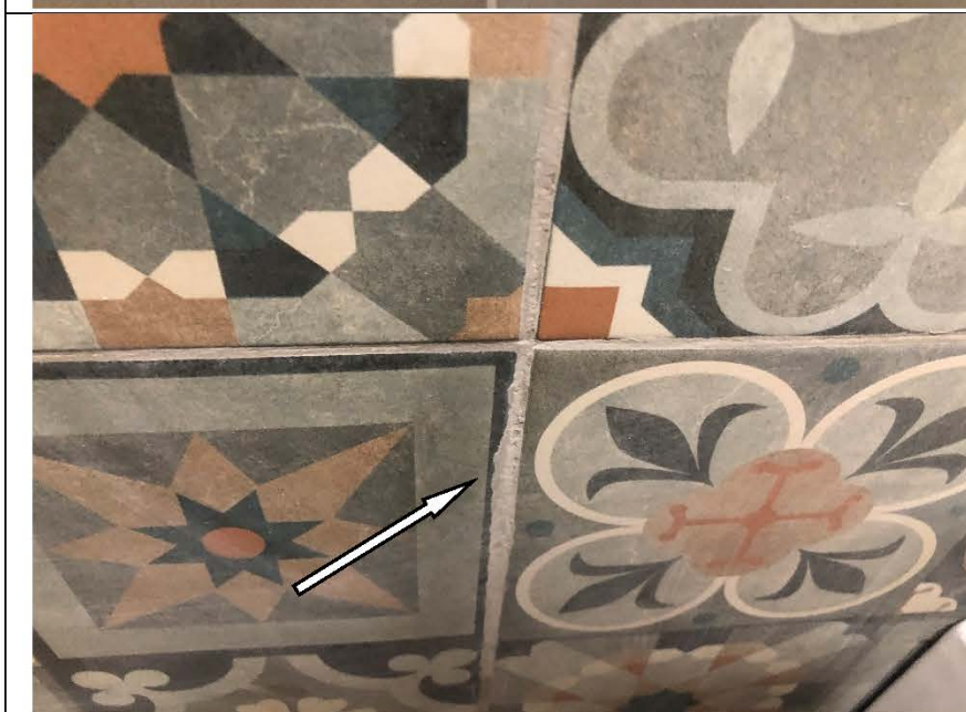
Фото №54. Загрязнения на настенной керамической плитке в ванной комнате в квартире.
