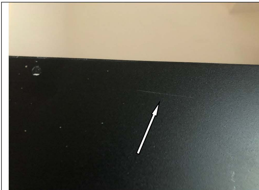
Фото №10. Царапина на полотне входной металлической двери в коридоре в квартире.
