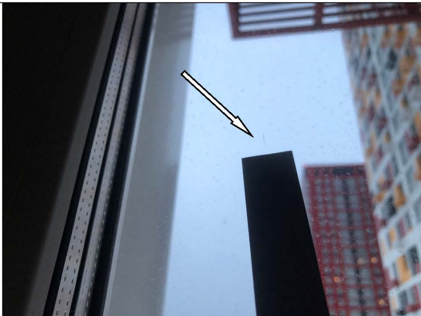
Фото №37. Царапины на стеклопакете оконного блока ПВХ в спальне в квартире.
