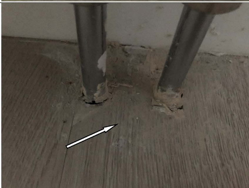
Фото №30. Загрязнения на ламинате в спальне в квартире.
