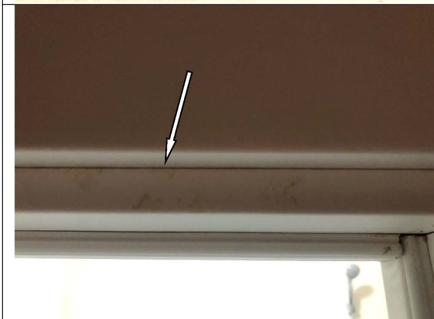
Фото №9. Загрязнение коробки деревянного дверного блока в ванной комнате в квартире.
