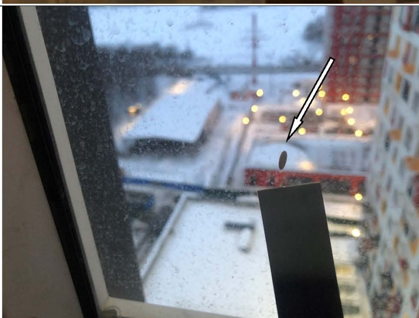
Фото №39. Окарины на стеклопакете оконного блока ПВХ на лоджии в квартире.
