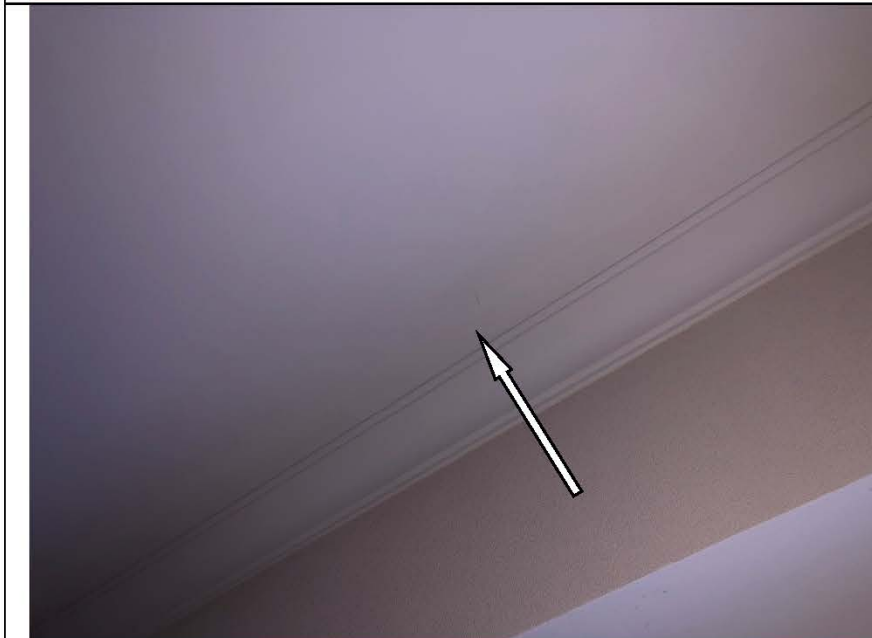
Фото №20. Неровности, сколы на окрашенном потолке в спальне в квартире.
