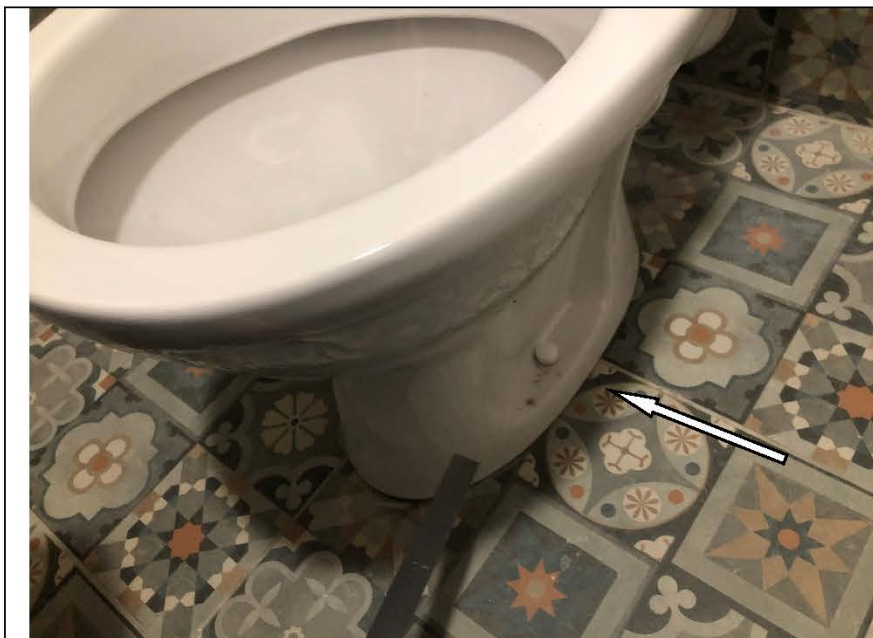
Фото №52. Неустойчиво закреплен унитаз в ванной комнате в квартире.
