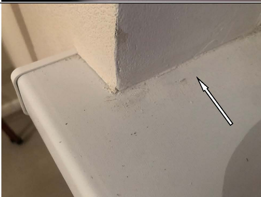
Фото №41. Загрязнения на подоконной доске в кухне в квартире.
