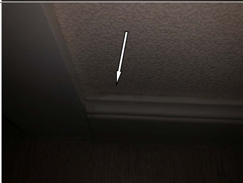
Фото №24. Загрязнение напольного плинтуса ПВХ в спальне в квартире.
