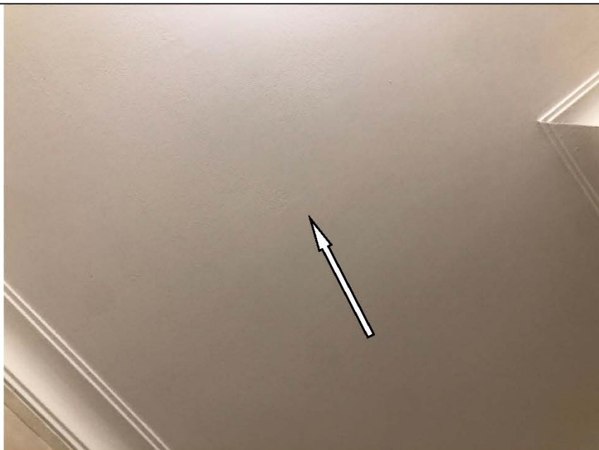
Фото №22. Неровности, сколы на окрашенном потолке в ванной комнате в квартире.
