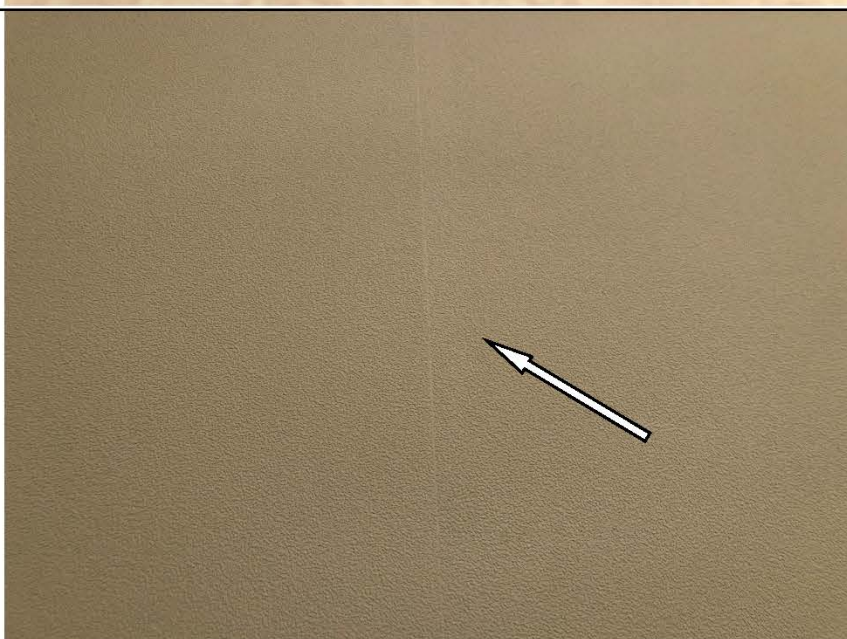
Фото №47. Воздушные пузыри на стенах, оклеенных обоями, в кухне в квартире.
