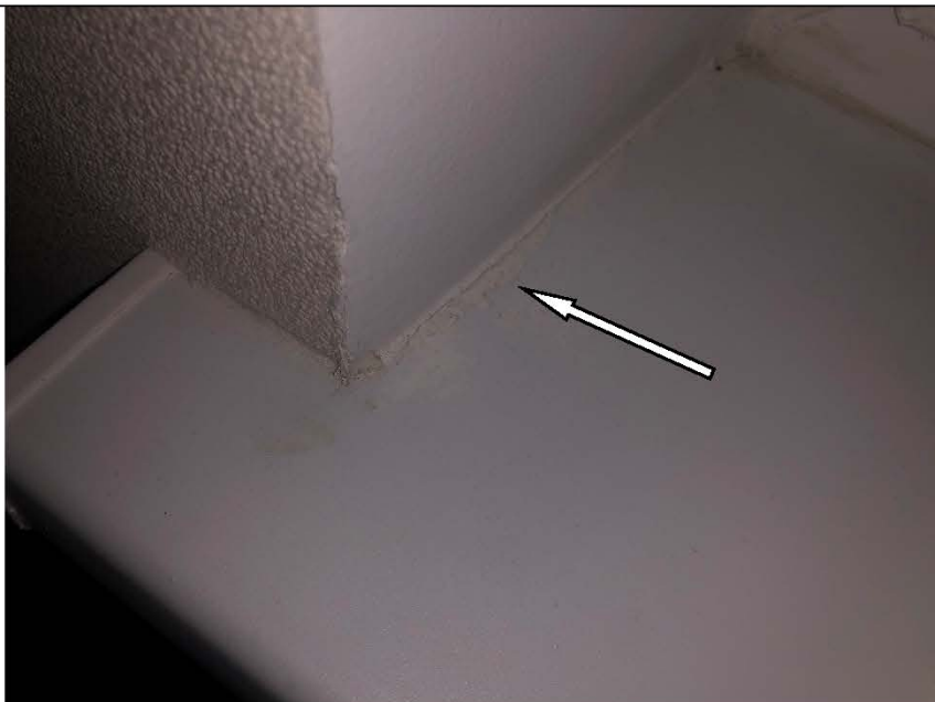
Фото №40. Загрязнения на подоконной доске в спальне в квартире.
