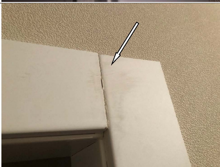
Фото №27. Загрязнение на наличнике деревянного дверного блока в кухне в квартире.
