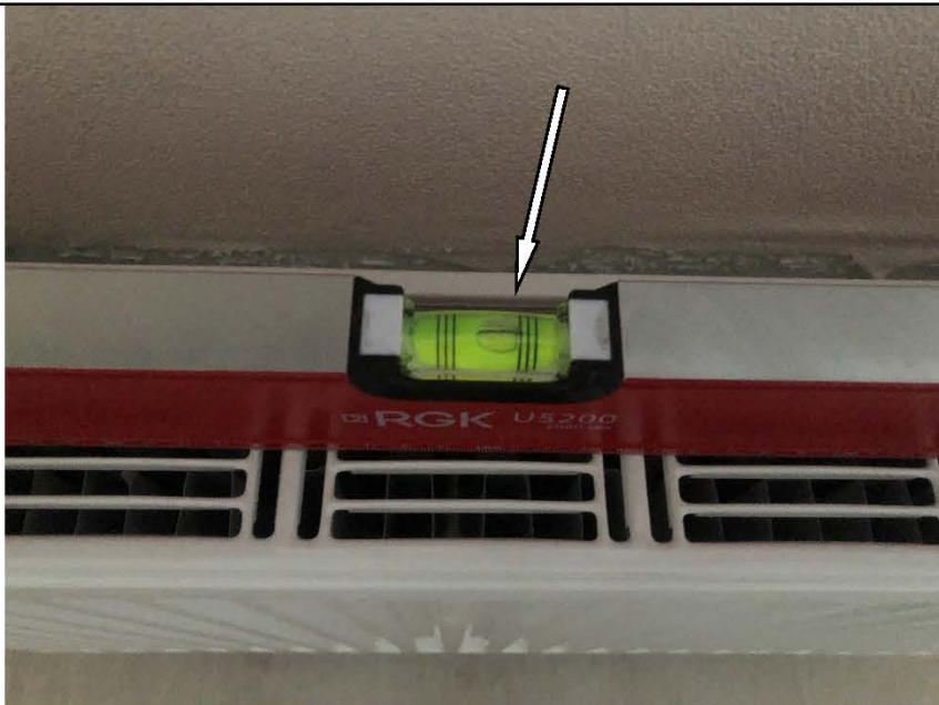
Фото №32. Неровно смонтирован отопительный прибор в спальне в квартире.
