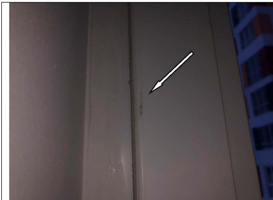
Фото №43. Загрязнения на профиле оконного блока ПВХ в спальне в квартире.
