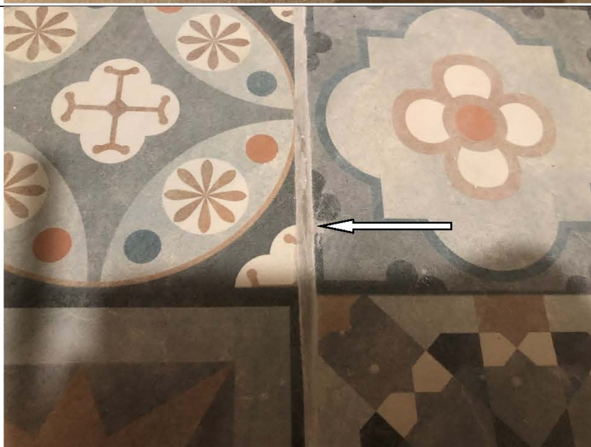
Фото №18. Неровный шов напольной керамической плитки в ванной комнате в квартире.
