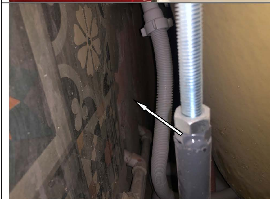
Фото №56. Частично не хватает настенной керамической плитки в ванной комнате в квартире.
