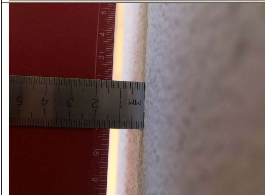
Фото №51. Измерение уровня стен лоджии в квартире.
