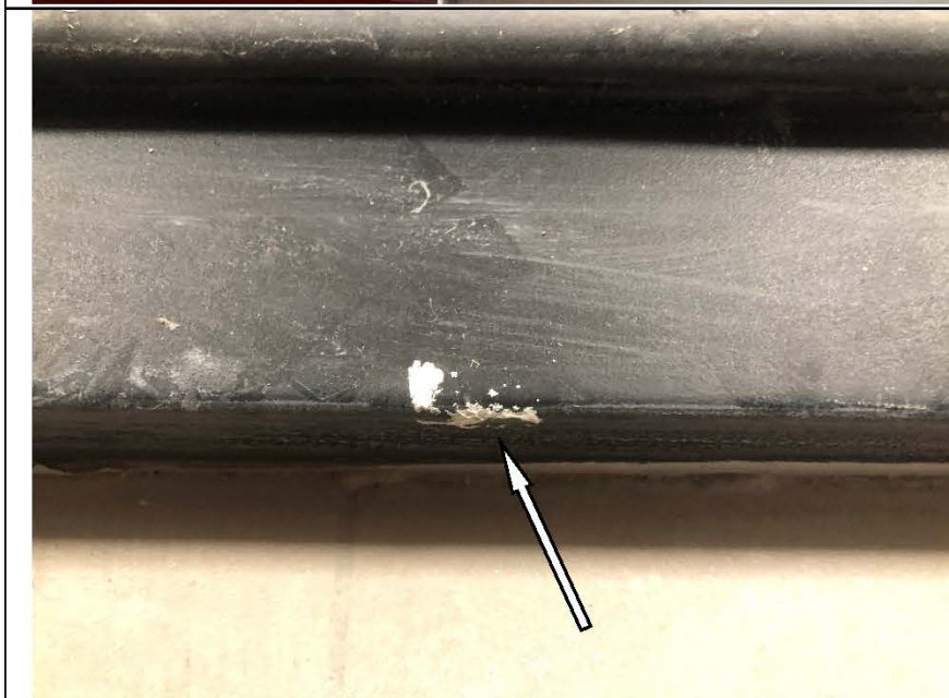
Фото №8. Загрязнение коробки входной металлической двери в коридоре в квартире.
