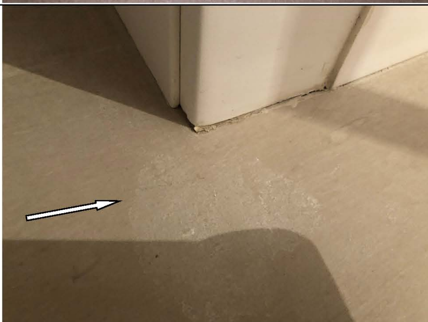
Фото №14. Загрязнения на напольной керамической плитке в кухне в квартире.
