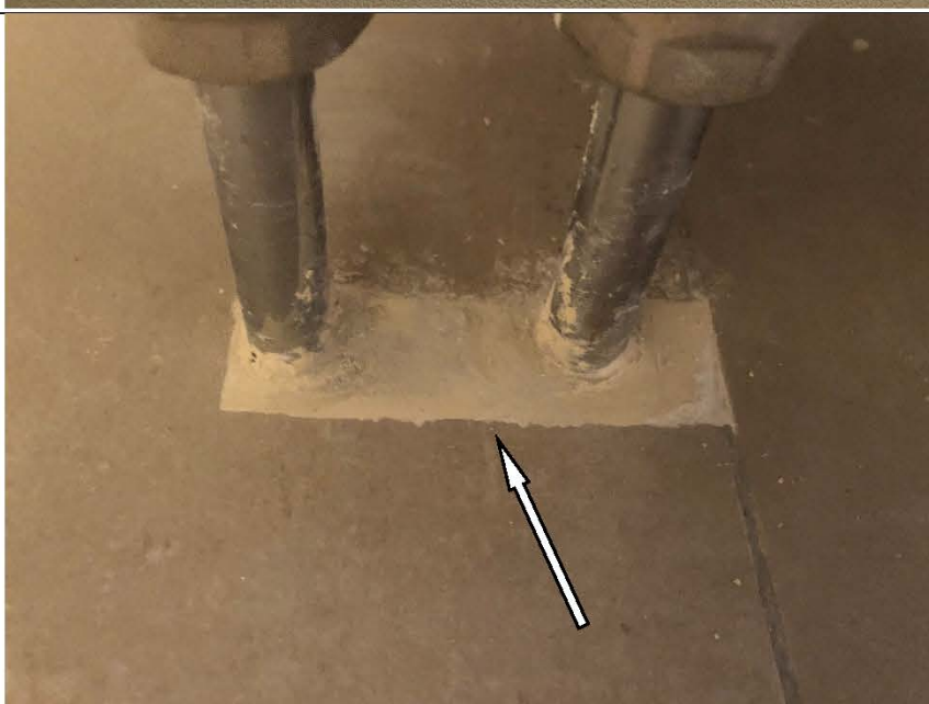
Фото №48. Дефект вставки труб отопления в напольное покрытие из керамической плитки в кухне в квартире.
