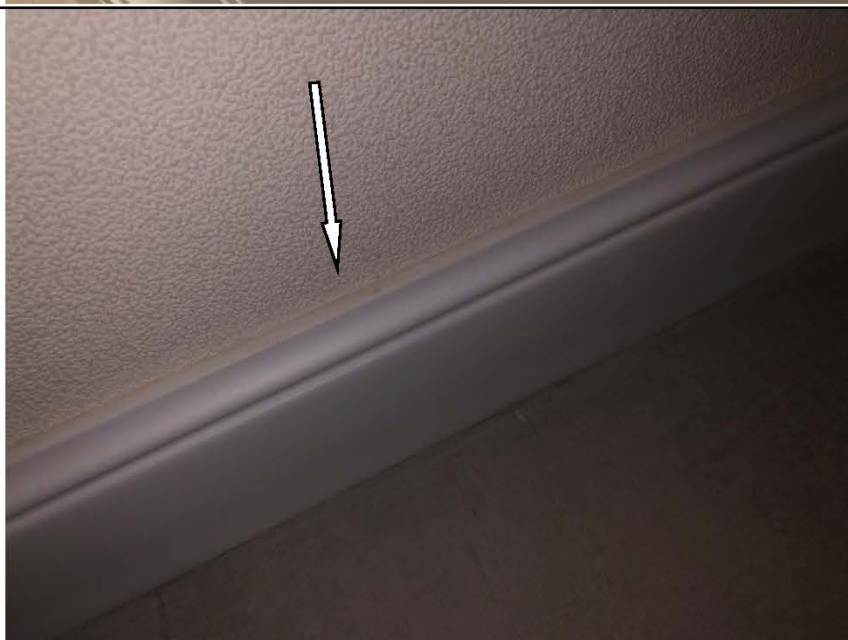
Фото №23. Загрязнение напольного плинтуса ПВХ в коридоре в квартире.
