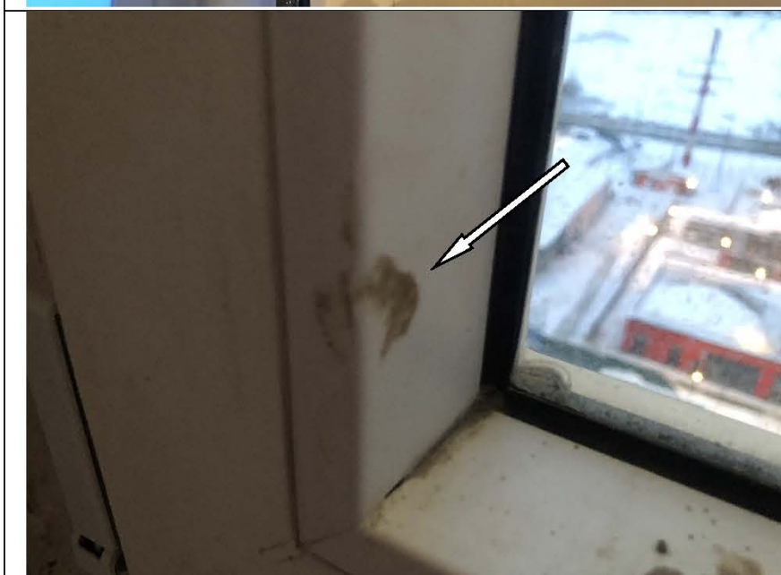
Фото №45. Загрязнения на профиле оконного блока ПВХ на лоджии в квартире.
