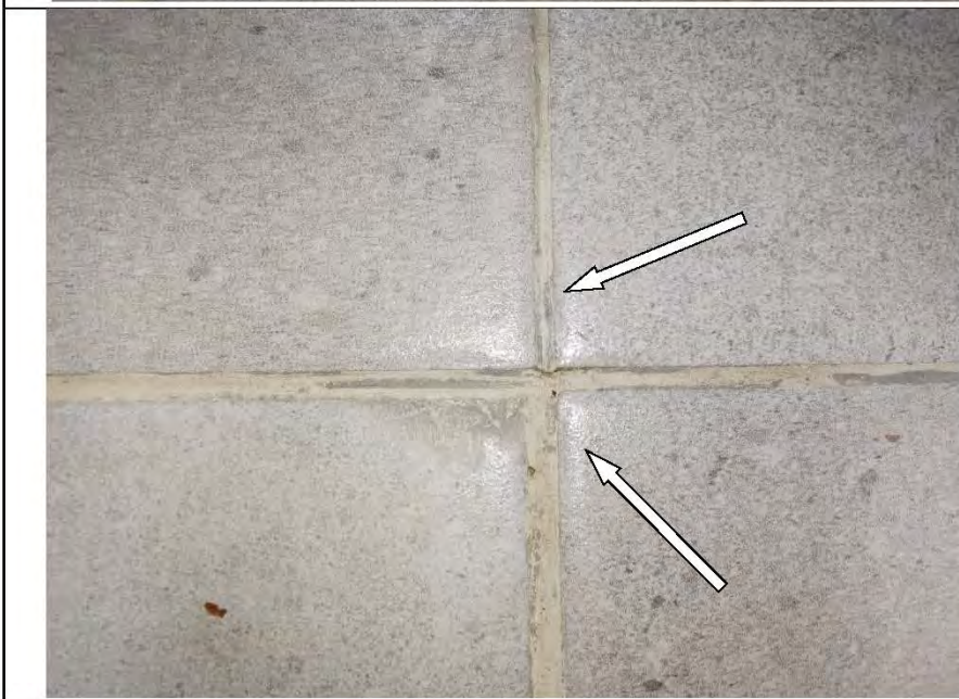
Фото №24. Затирка напольной плитки в санузле выполнена с нарушениями.
