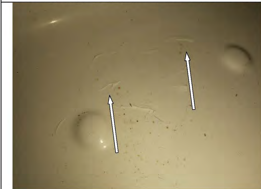
Фото №44. Загрязнение на душевом поддоне в санузле.
