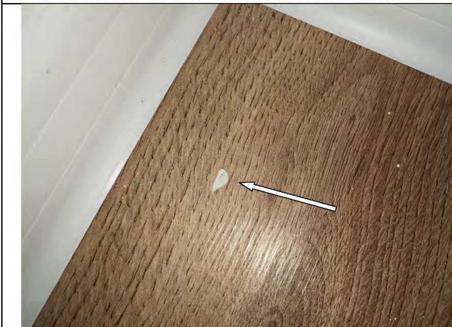
Фото №20. Загрязнение ламината в комнате.
