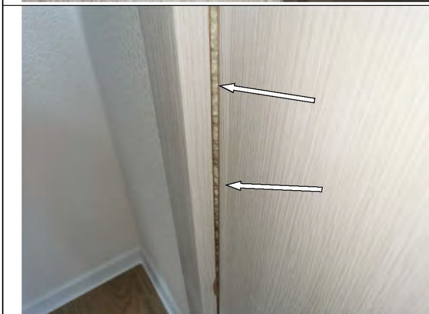
Фото №39. Элементы дверного блока (наличники) соединены не надежно в санузле.
