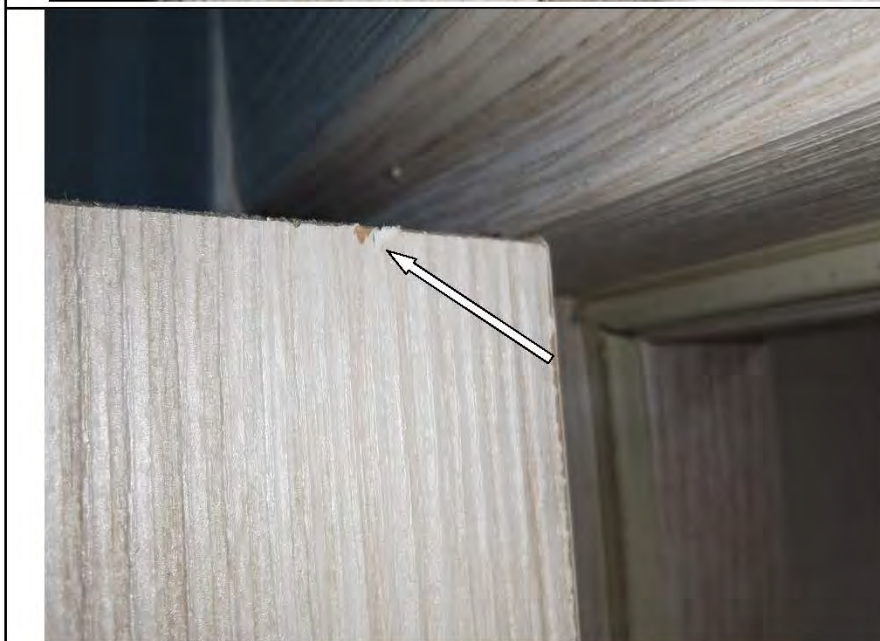
Фото №38. Повреждение ламинации полотна деревянного дверного блока в санузле.
