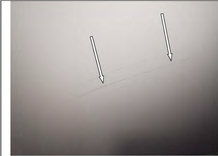
Фото №16. Цеди на настенной керамической плитке в санузле.
