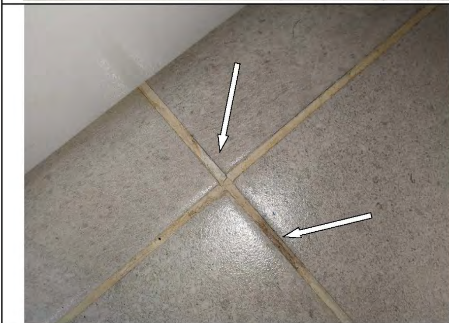
Фото №23. Затирка напольной плитки в санузле выполнена с нарушениями.
