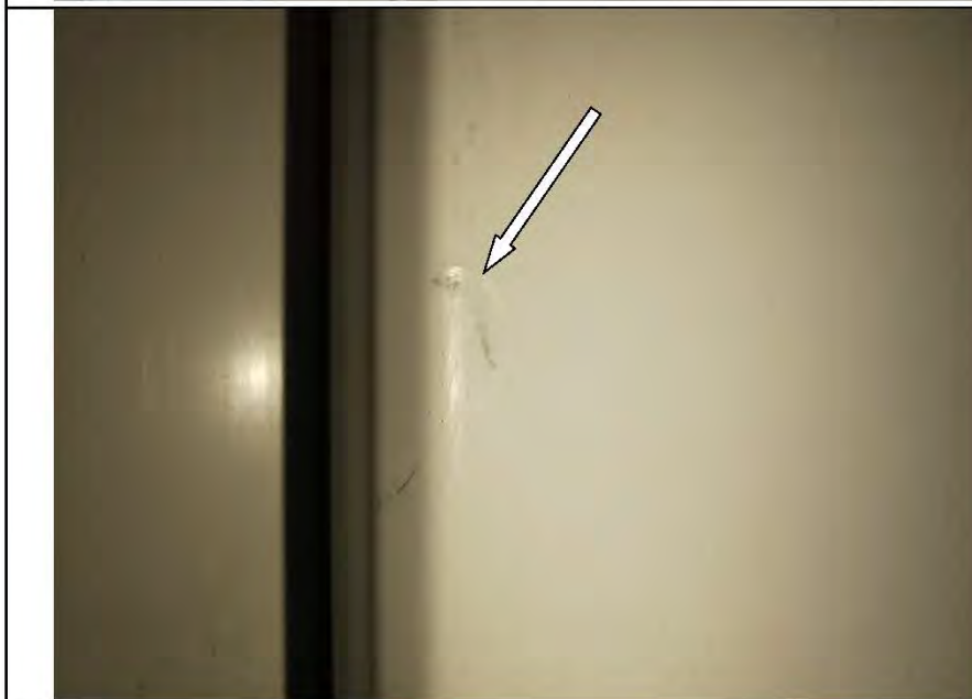
Фото №29. Царапины на профиле ПВХ оконного блока в комнате.
