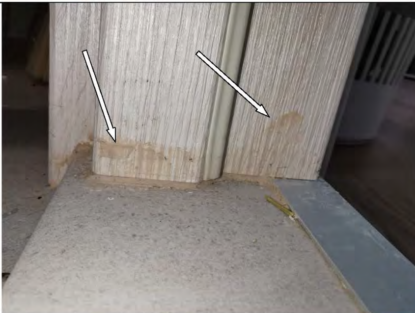
Фото №41. Загрязнение короба деревянного дверного блока в санузле.
