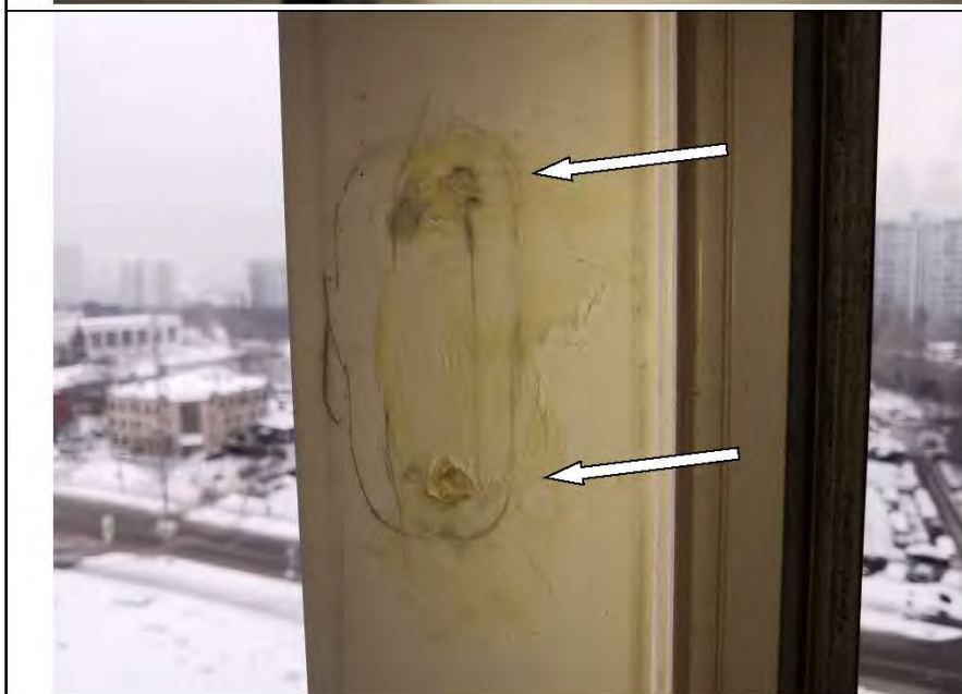
Фото №30. Нарушение целостности профиля ПВХ, загрязнение оконного блока в комнате.
