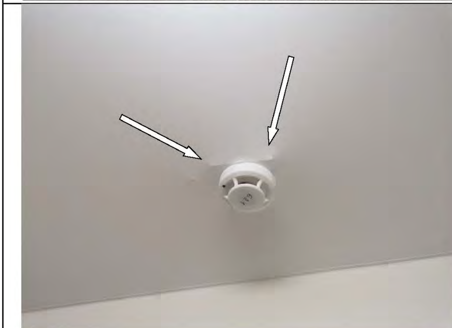
Фото №26. На полотне натяжного потолка в санузле видны инженерные сети.
