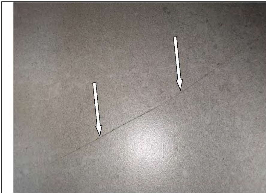
Фото №25. Трещины на напольной керамической плитке в санузле.
