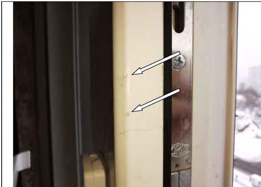
Фото №31. Сколы на профиле ПВХ оконного блока в комнате.
