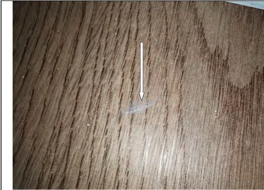
Фото №19. Царапины на ламинате в комнате.
