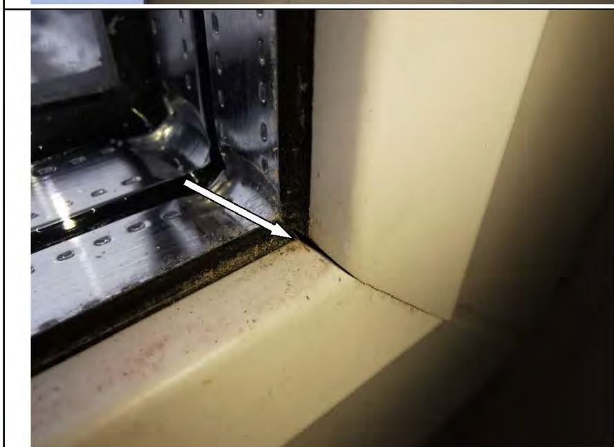
Фото №33. Зазор в месте стыка профилей ПВХ оконного блока в комнате.
