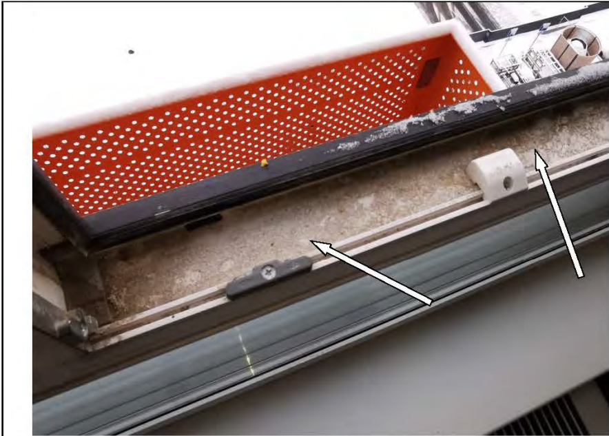
Фото №34. Загрязнение профиля ПВХ оконного блока в комнате.
