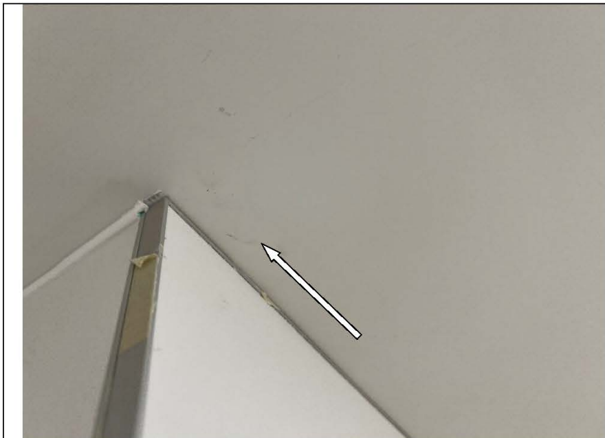
Фото №73. Загрязнение поверхности потолка в санузле.
