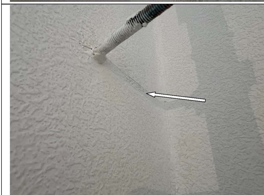
Фото №15. Читаемые обойные стыки в спальне.
