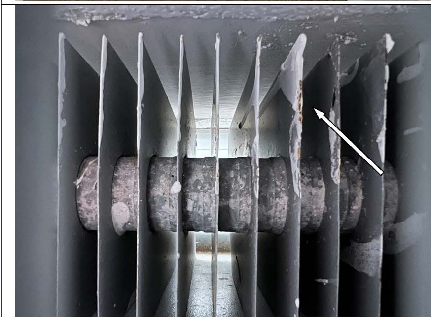
Фото №90. Коррозия на сотах радиатора в гостиной.
