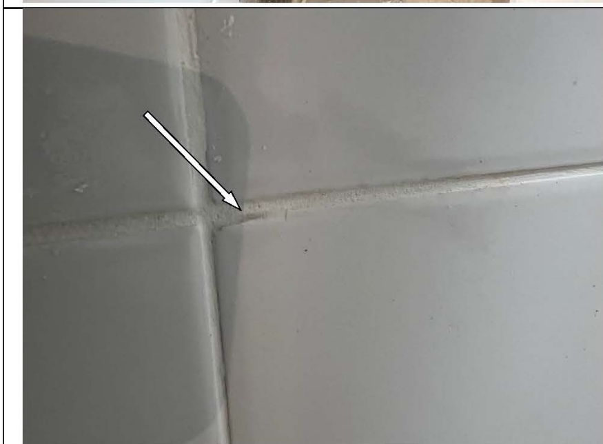
Фото №24. Отбитости настенной керамической плитки в санузле.
