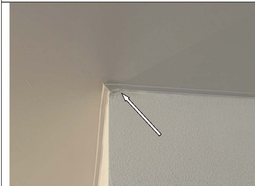
Фото №20. Скол обоевого полотна в кухне.
