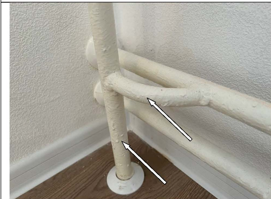
Фото №89. Подтеки краски на трубах отопления в кухне.
