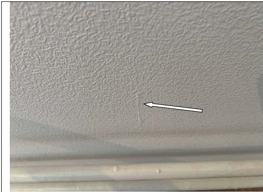
Фото №16. Читаемые обойные стыки в спальне.
