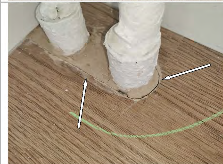
Фото №51. Заделка отверстия для трубопровода отопления в напольном покрытии из ламината выполнена с дефектом в гостиной.
