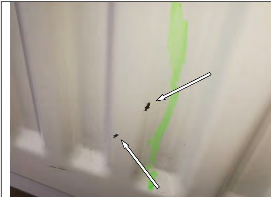
Фото №124. Радиатор в гостиной имеет дефекты (потертости).
