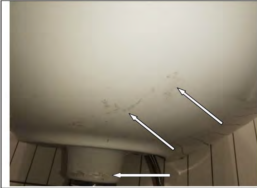
Фото №127. Загрязнение раковины в ванной комнате.
