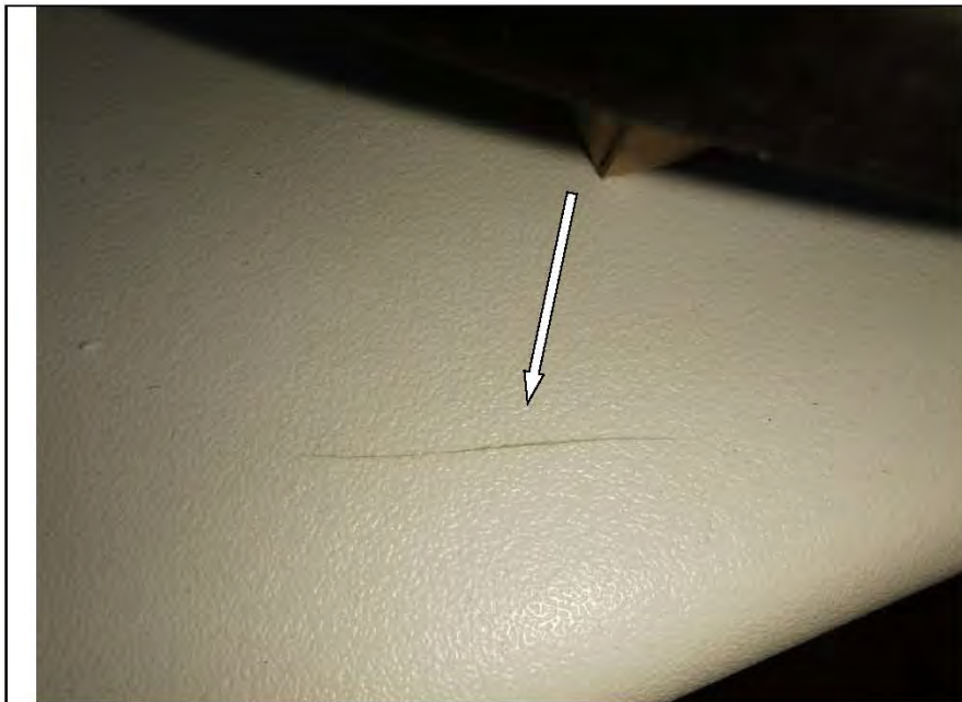
Фото №100. Царапины на лицевой поверхности подоконной доски в кухне.
