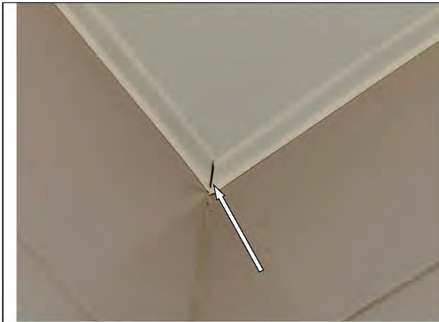
Фото №64. Дефект монтажа декоративного молдинга крепления натяжного потолка в санузле.
