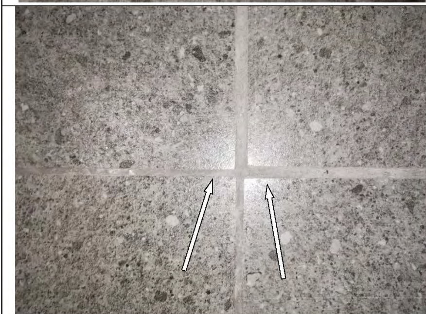
Фото №57. Затирка напольной плитки в ванной комнате выполнена с нарушениями.
