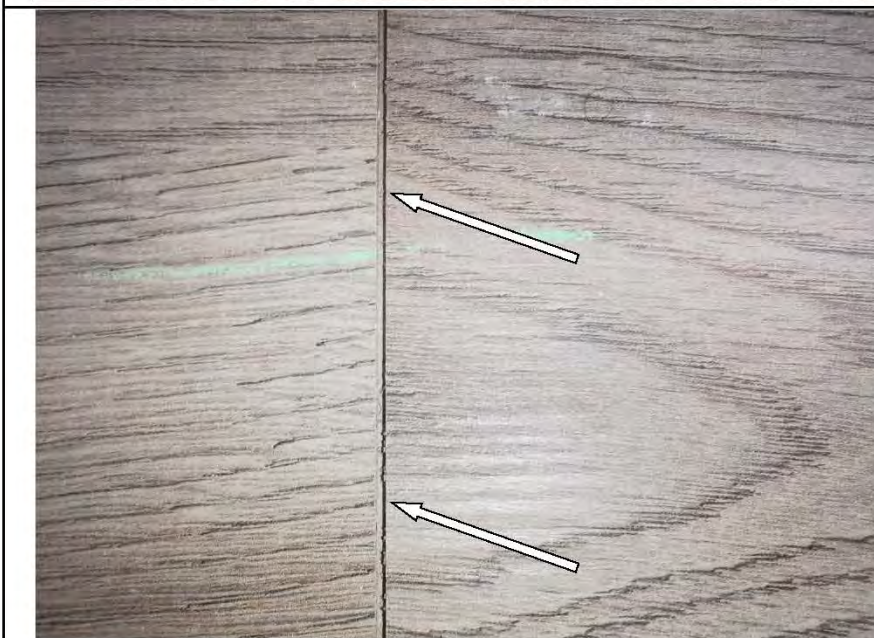
Фото №41. Зазоры между соседними досками ламината в коридоре.
