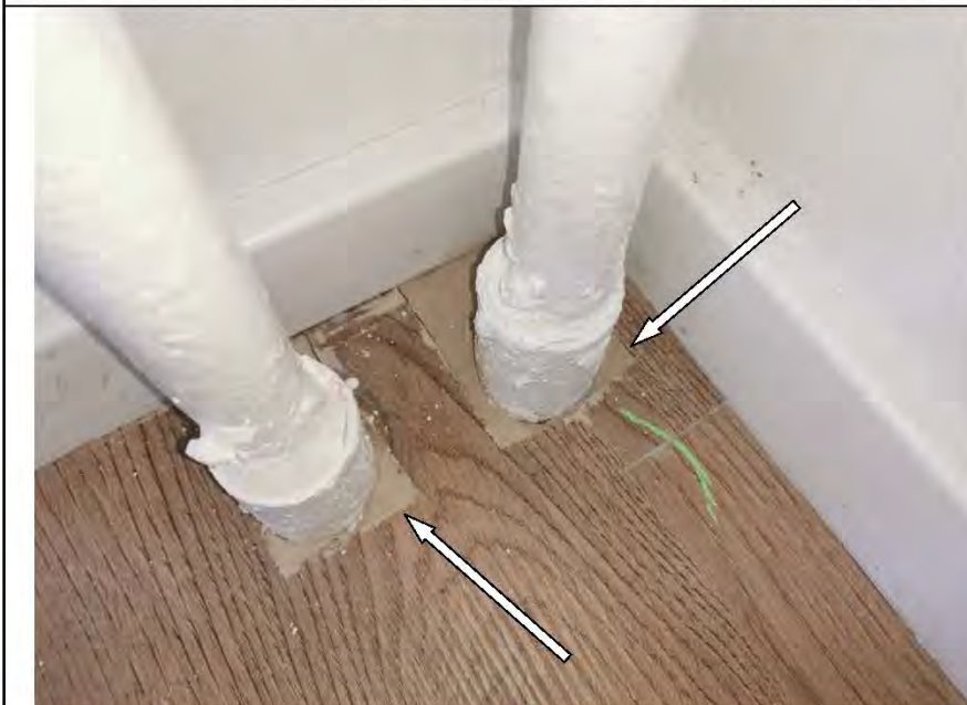
Фото №50. Заделка отверстия для трубопровода отопления в напольном покрытии из ламината выполнена с дефектом в кухне.
