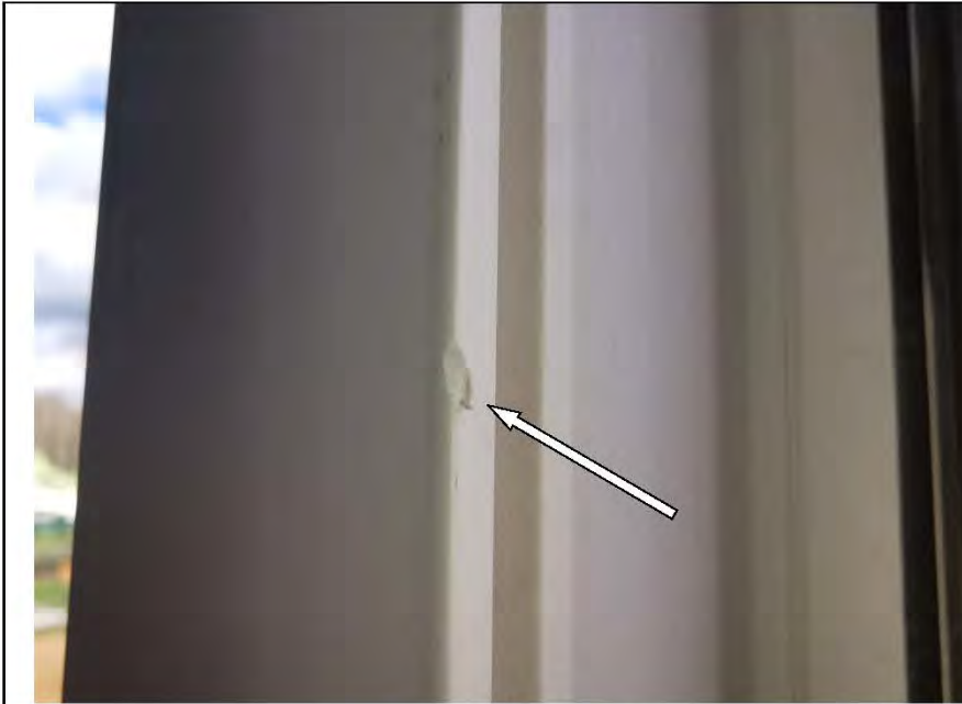
Фото №85. Механическое повреждение профиля ПВХ оконного блока в спальне.
