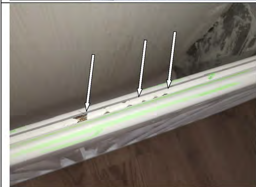
Фото №123. Радиатор на кухне имеет дефекты (потертости, коррозия).
