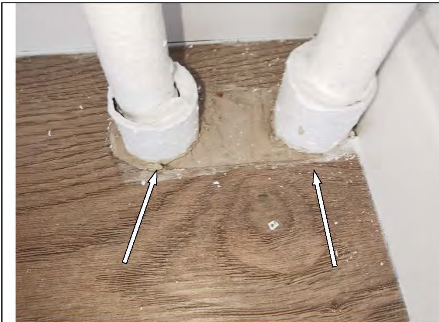
Фото №52. Заделка отверстия для трубопровода отопления в напольном покрытии из ламината выполнена с дефектом в спальне.
