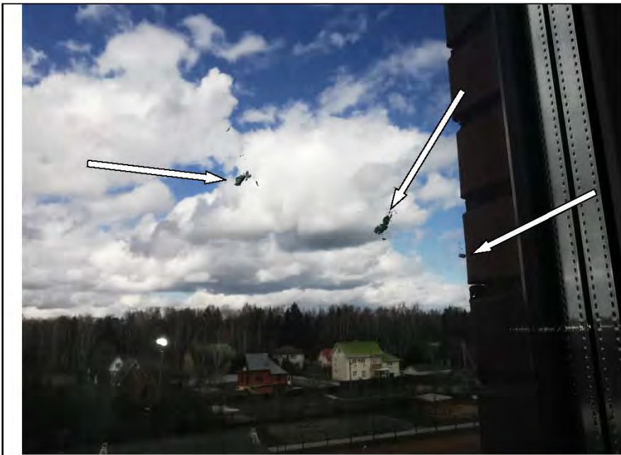
Фото №91. Загрязнения на стеклопакете оконного блока ПВХ в гостиной.
