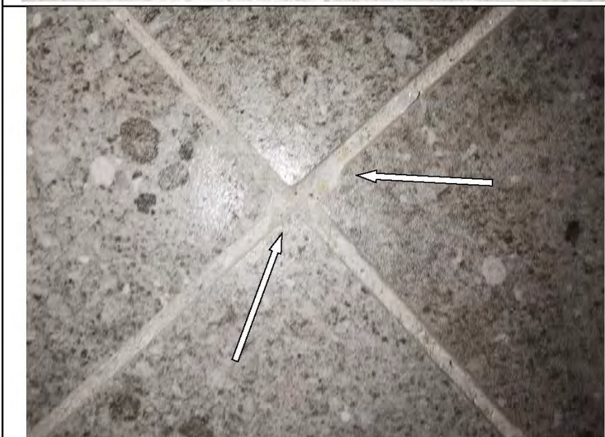
Фото №56. Затирка напольной плитки в санузле выполнена с нарушениями.
