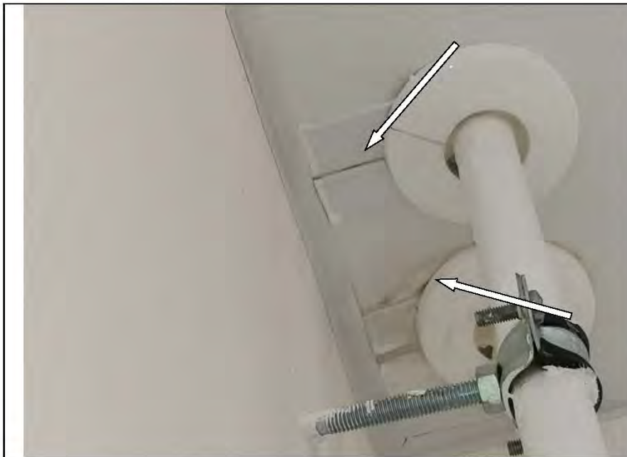
Фото №61. Заделка отверстия для трубопровода отопления на натяжном потолке выполнена с дефектом в кухне.
