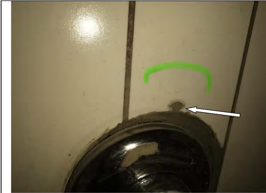
Фото №34. Отбитости на настенной керамической плитке в ванной комнате.
