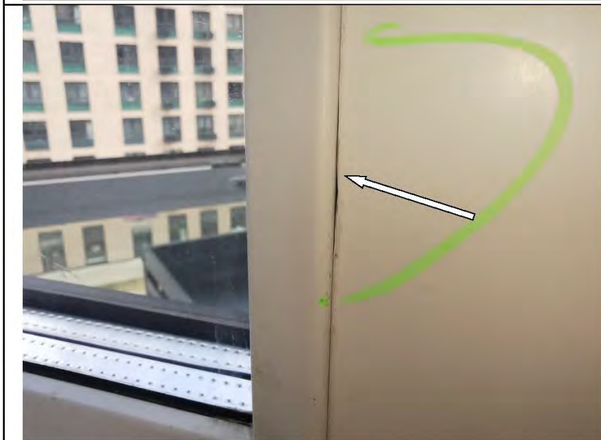
Фото №80. Механическое повреждение профиля ПВХ оконного блока в спальне.
