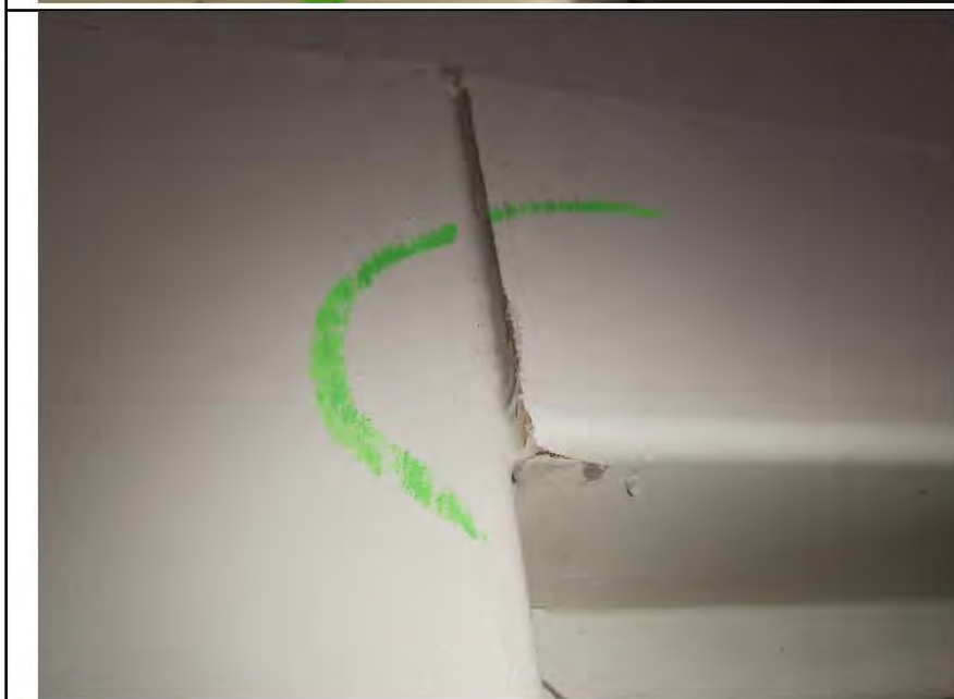
Фото №110. Механические повреждения на наличнике деревянного дверного блока в кухне.
