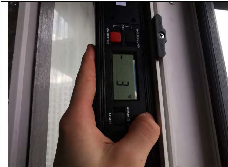
Фото №94. Отклонение ПВХ оконного блока в кухне по уровню вертикальности.
