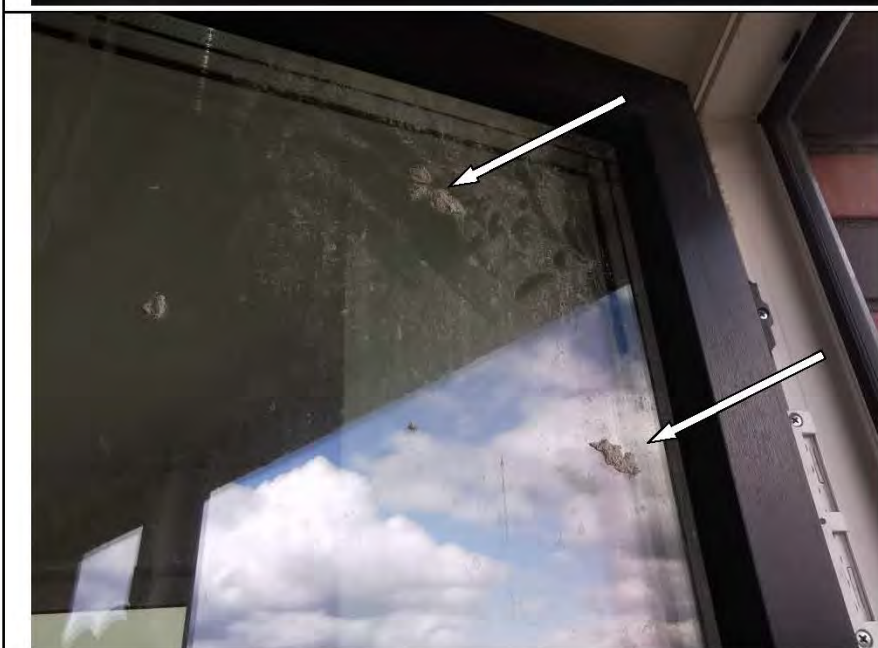
Фото №90. Загрязнения на стеклопакете оконного блока ПВХ в гостиной.
