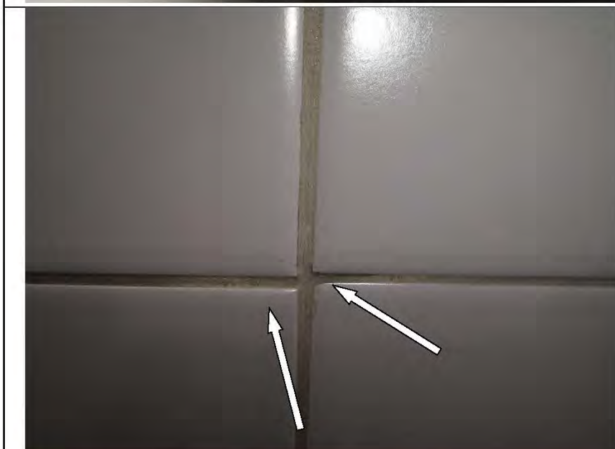
Фото №29. Затирка настенной плитки в ванной комнате выполнена с нарушениями.
