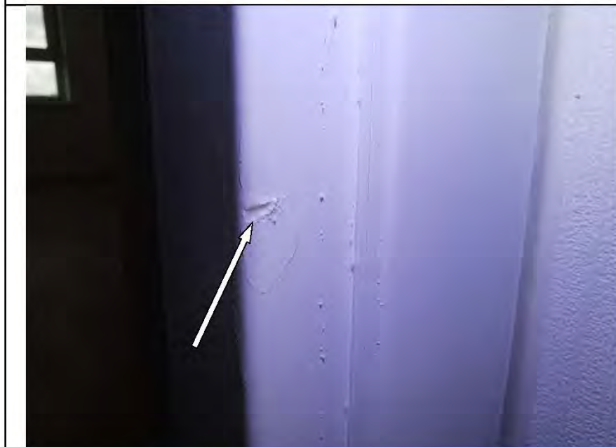
Фото №113. Механические повреждения на коробе деревянного дверного блока в гостиной.
