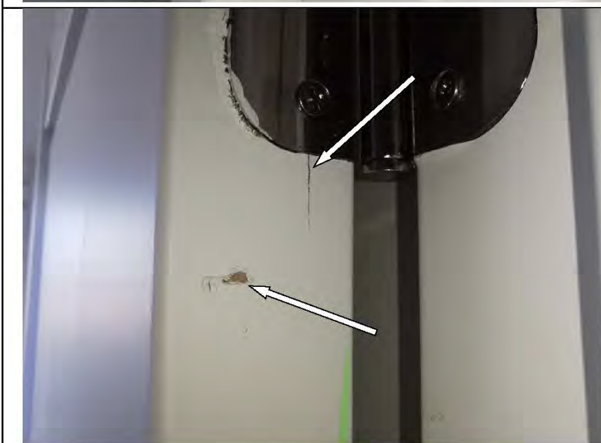
Фото №117. Механические повреждения на полотне деревянного дверного блока в спальне.
