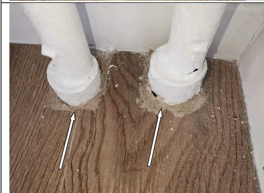
Фото №53. Заделка отверстия для трубопровода отопления в напольном покрытии из ламината выполнена с дефектом в спальне.
