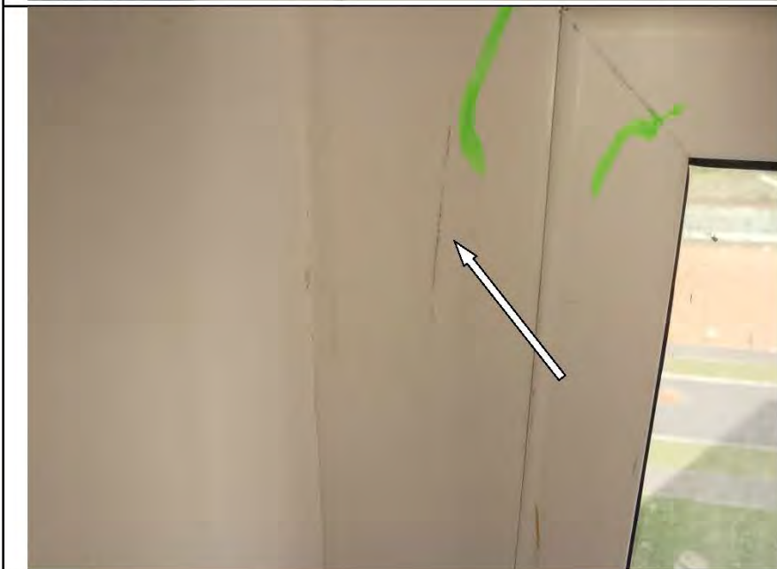
Фото №83. Потертости на профиле ПВХ оконного блока в спальне.
