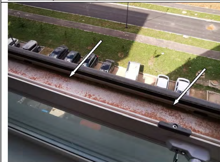
Фото №87. Загрязнение профиля ПВХ оконного блока в спальне.
