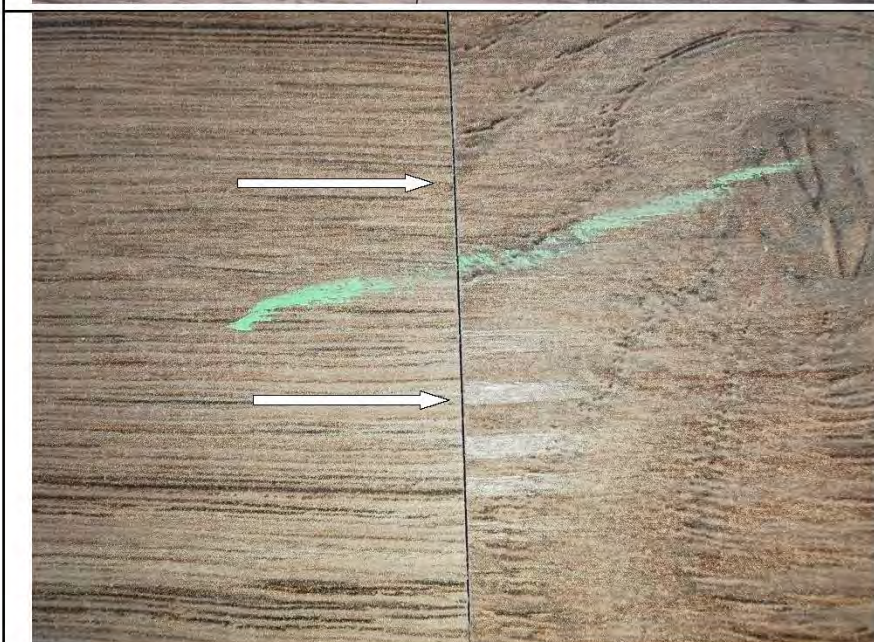
Фото №44. Зазоры между соседними досками ламината в гостиной.
