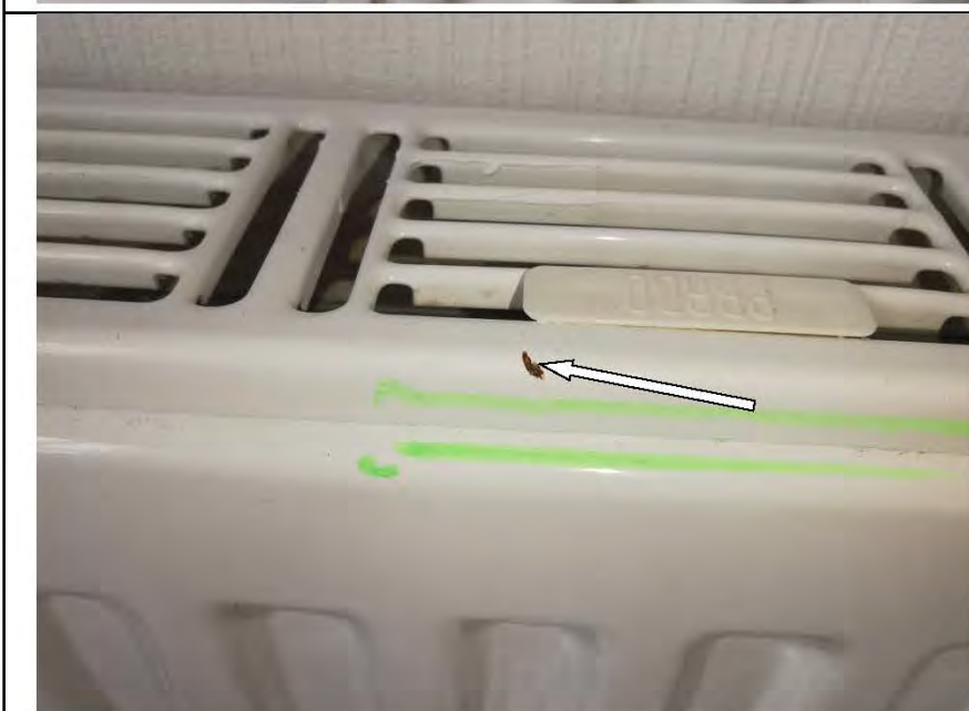
Фото №126. Радиатор в спальне имеет дефекты (потертости, коррозия)
