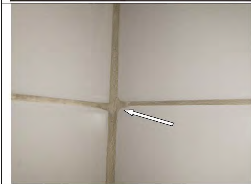
Фото №30. Затирка настенной плитки в ванной комнате выполнена с нарушениями.
