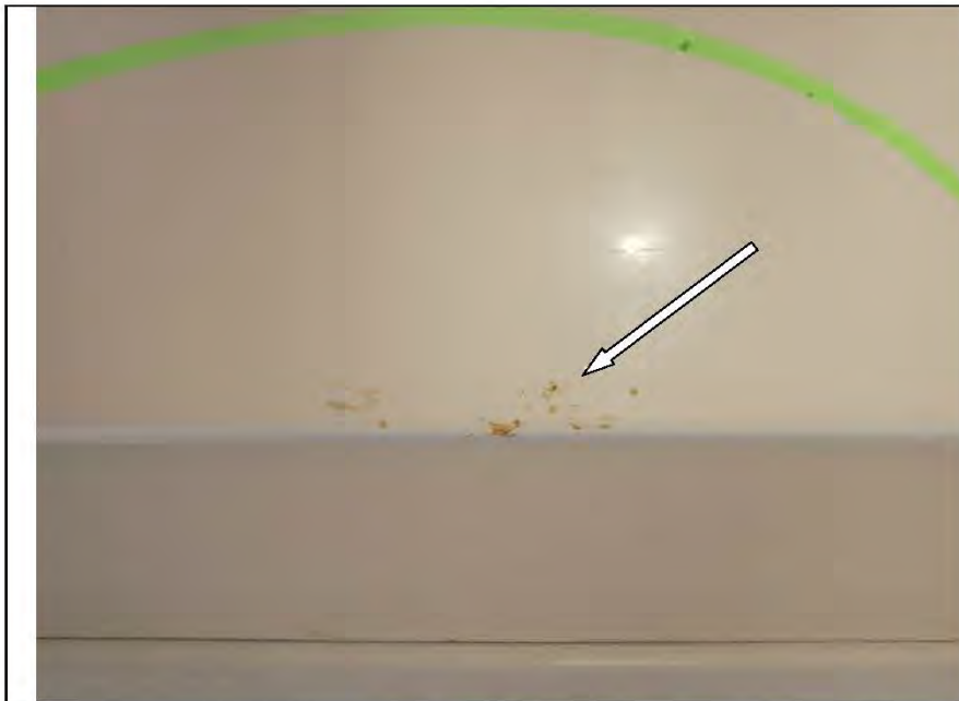
Фото №76. Загрязнение профиля ПВХ оконного блока в гостиной.
