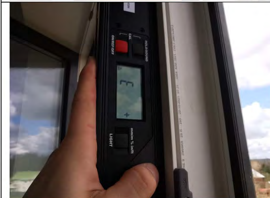
Фото №98. Отклонение ПВХ оконного блока в спальне по уровню вертикальности.
