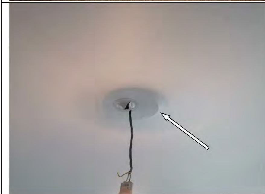
Фото №60. Видимость инженерных сетей на полотне натяжного потолка в кухне.
