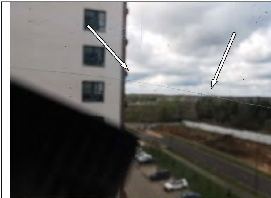
Фото №88. Царапины на стеклопакете оконного блока ПВХ в кухне.
