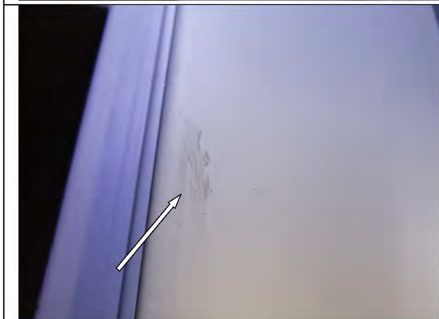
Фото №114. Загрязнения на коробе деревянного дверного блока в санузле.
