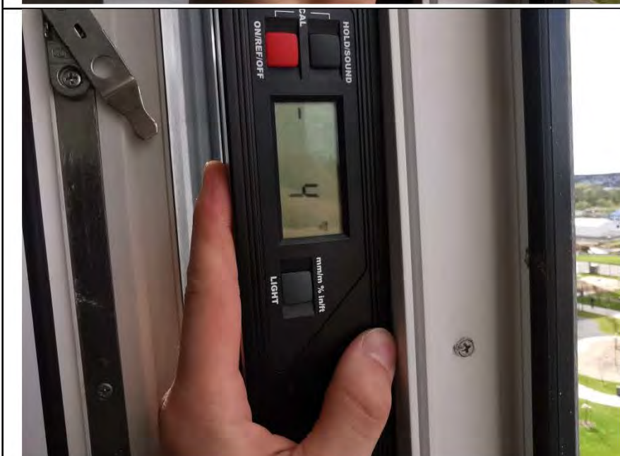
Фото №96. Отклонение ПВХ оконного блока в гостиной по уровню вертикальности.
