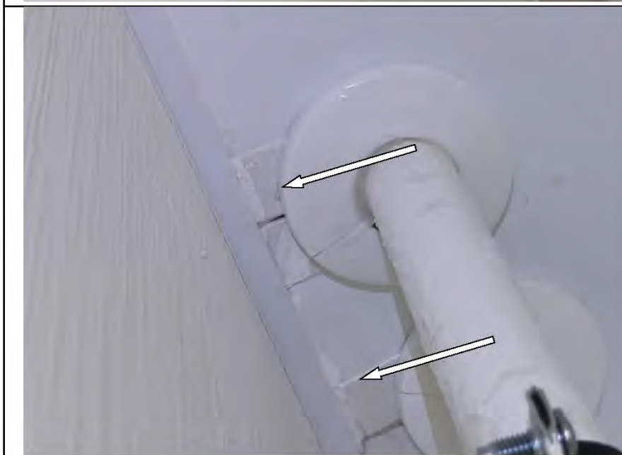
Фото №68. Заделка отверстия для трубопровода отопления на натяжном потолке выполнена с дефектом в спальне.
