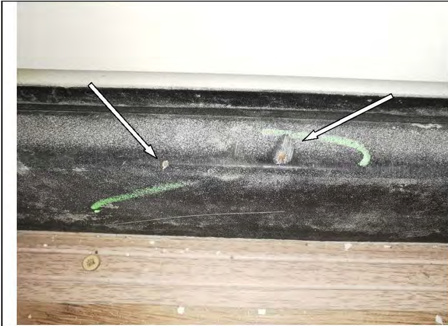
Фото №121. Механические повреждения и следы коррозии на коробе входного дверного блока.
