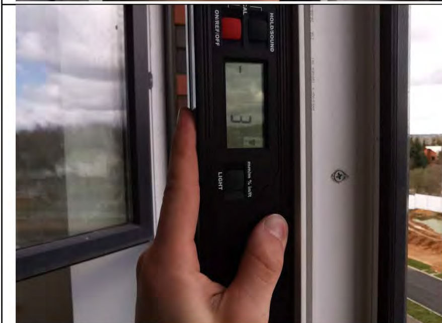
Фото №95. Отклонение ПВХ оконного блока в гостиной по уровню вертикальности.
