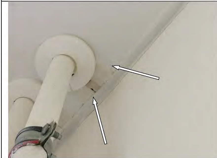
Фото №62. Заделка отверстия для трубопровода отопления на натяжном потолке выполнена с дефектом в гостиной.
