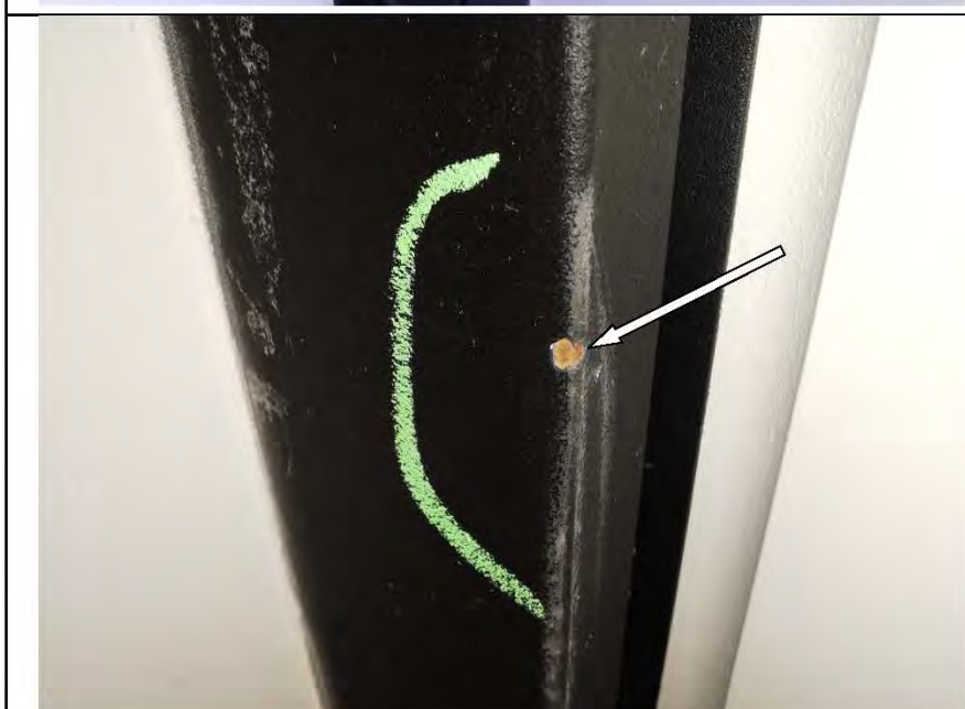
Фото №120. Скол, коррозия на коробе входного дверного блока.
