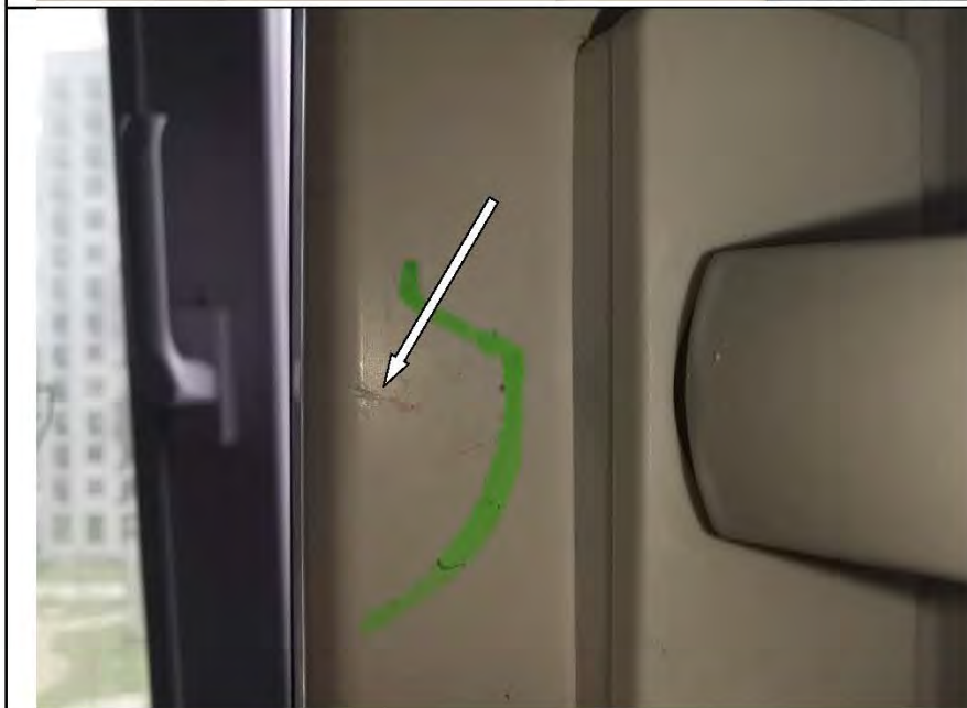
Фото №71. Царапины на профиле ПВХ оконного блока в кухне.
