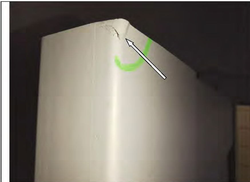
Фото №115. Механические повреждения на коробе деревянного дверного блока в ванной комнате.
