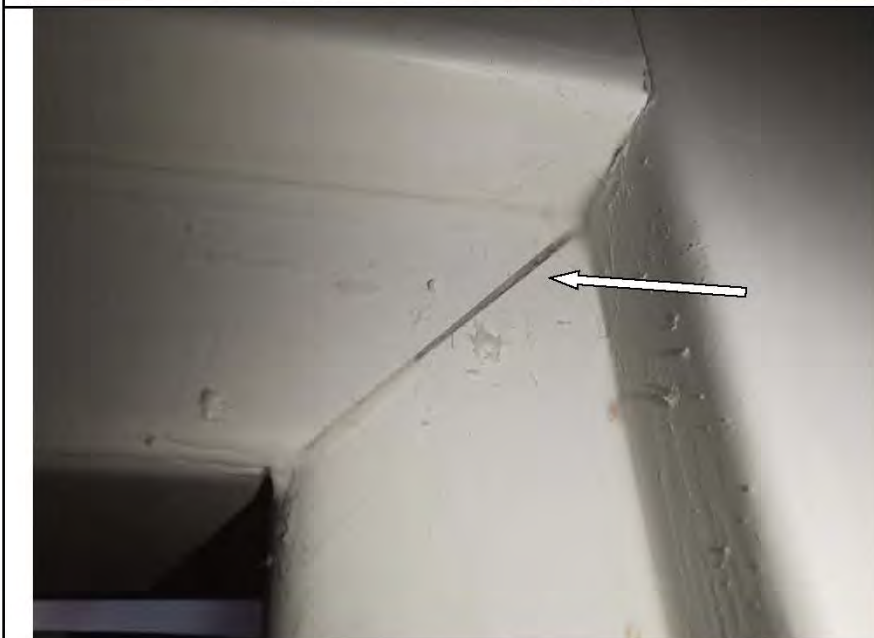
Фото №107. Элементы дверного блока (коробка) соединены не надежно в кухне.
