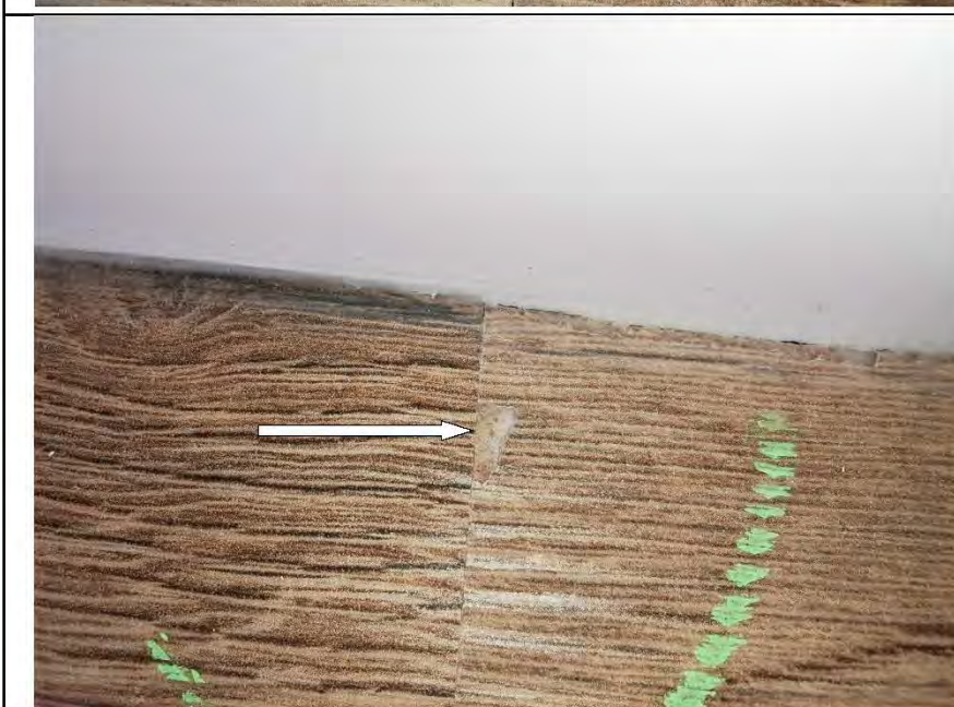
Фото №45. Скол на поверхности напольного покрытия из ламината в гостиной.
