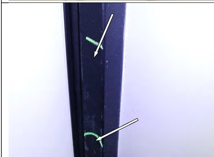
Фото №119. Царапины на коробе входного дверного блока.
