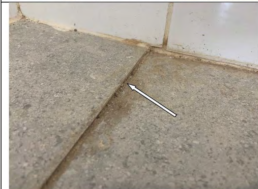
Фото №23. Уступы напольной керамической плитки в санузле.
