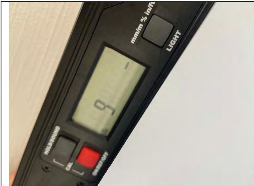
Фото №13. Отклонение поверхности стен от вертикали в спальне.
