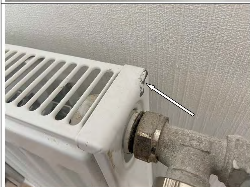
Фото №110. Дефект на поверхности металлического кожуха отопительного прибора в кухне.
