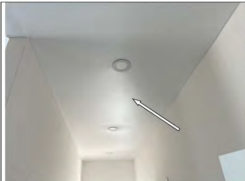
Фото №103. Дефект на поверхности натяжного потолка в коридоре.
