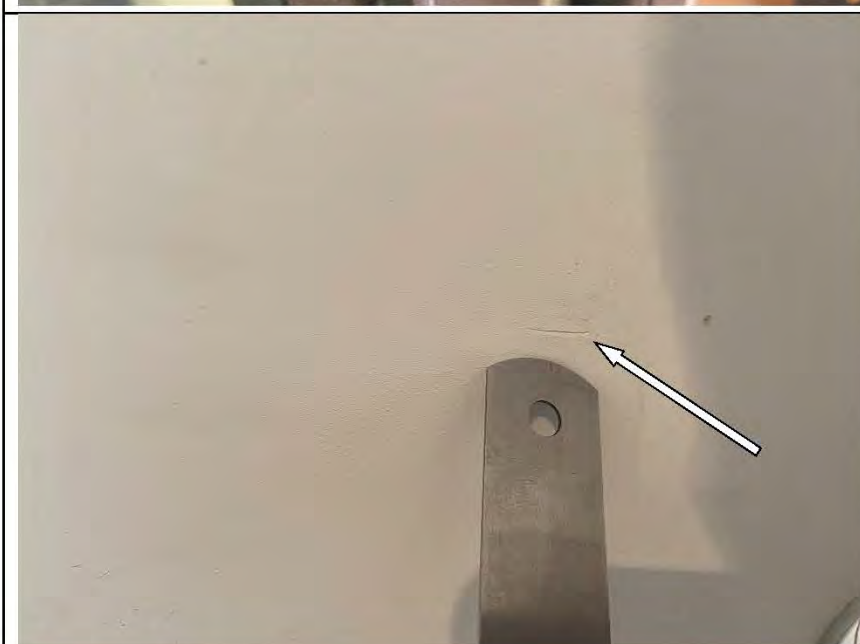
Фото №86. Дефект на полотне входного дверного блока в коридоре.
