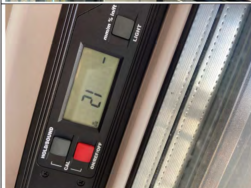
Фото №71. Отклонение по вертикали оконного блока ПВХ в кухне.
