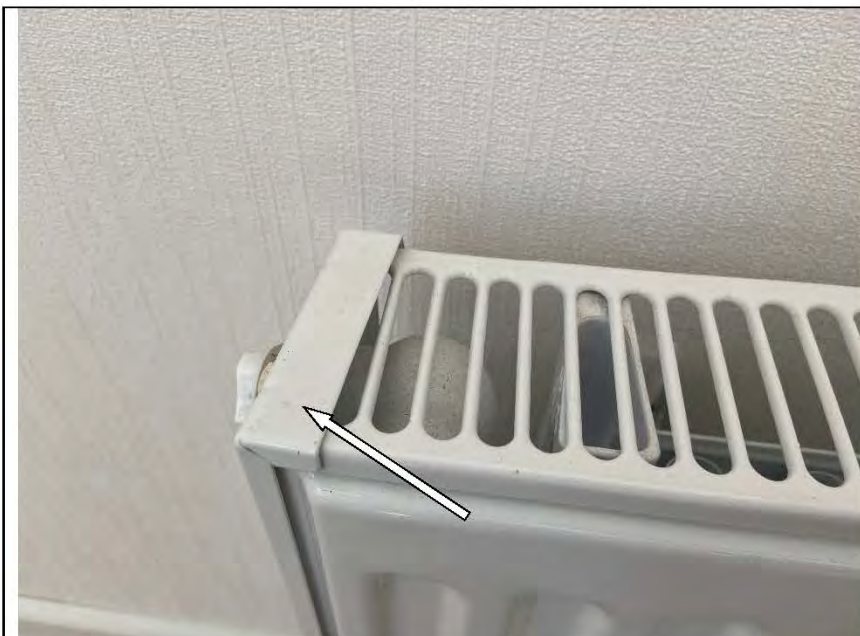
Фото №112. Дефект на поверхности металлического кожуха отопительного прибора в спальне.
