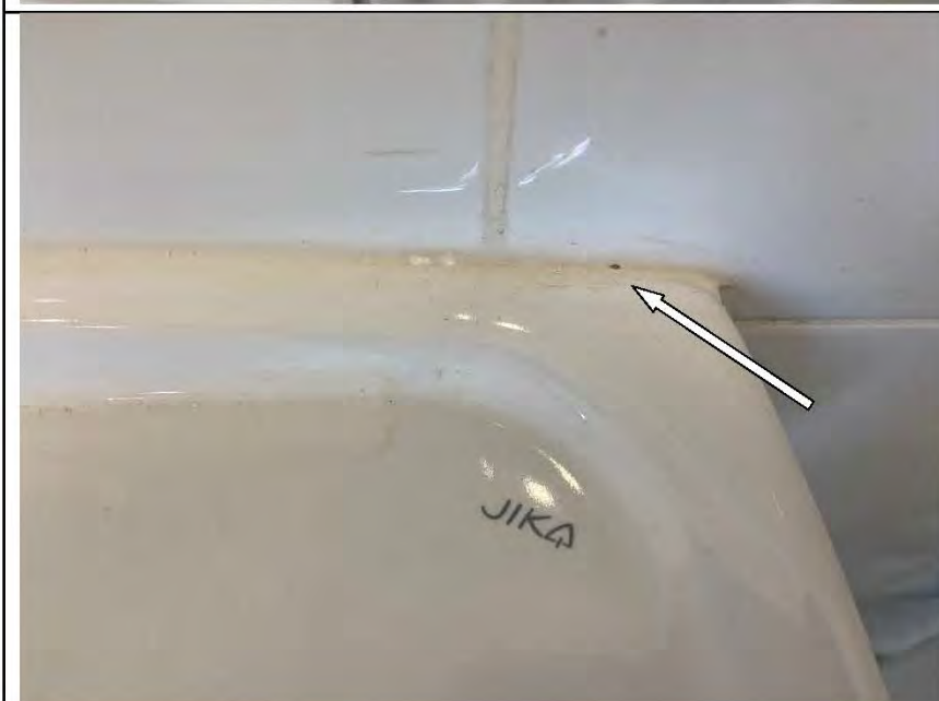
Фото №113. Загрязнения на раковине в санузле.
