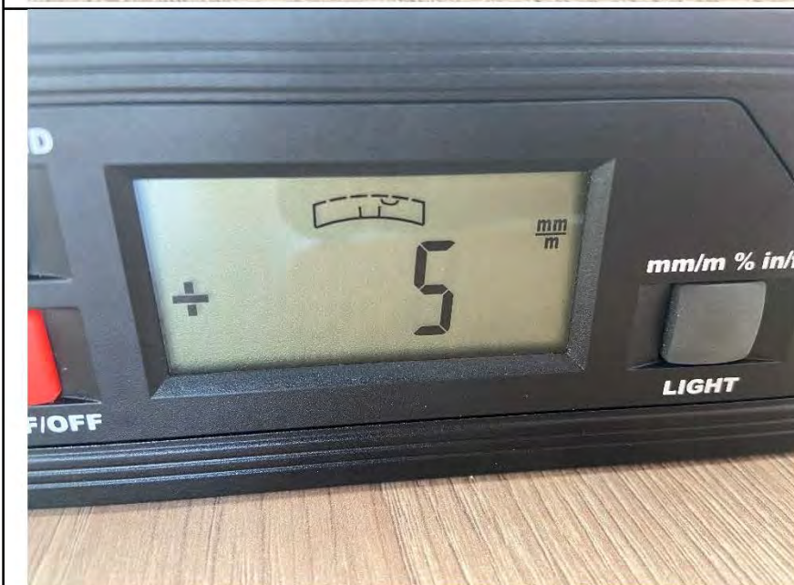
Фото №27. Отклонение поверхности напольного покрытия из ламината в спальне.
