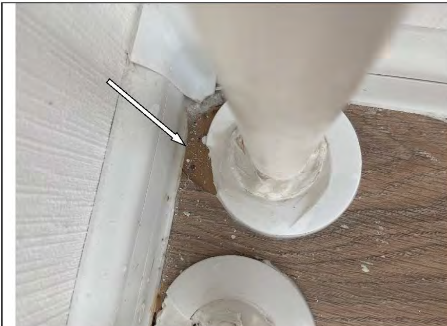
Фото №46. Дефект вставки труб отопления в напольное покрытие из ламината в кабинете.
