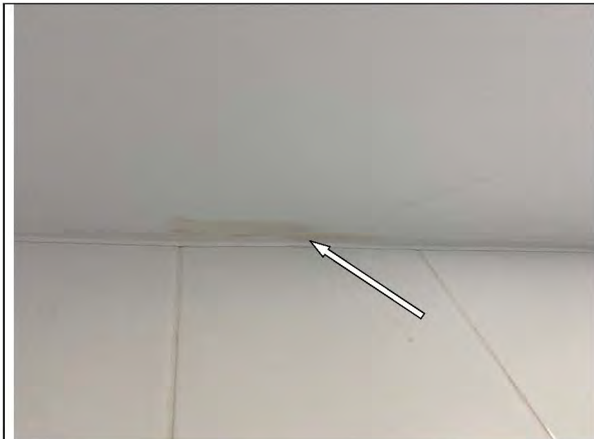
Фото №106. Дефект на поверхности натяжного потолка в санузле.
