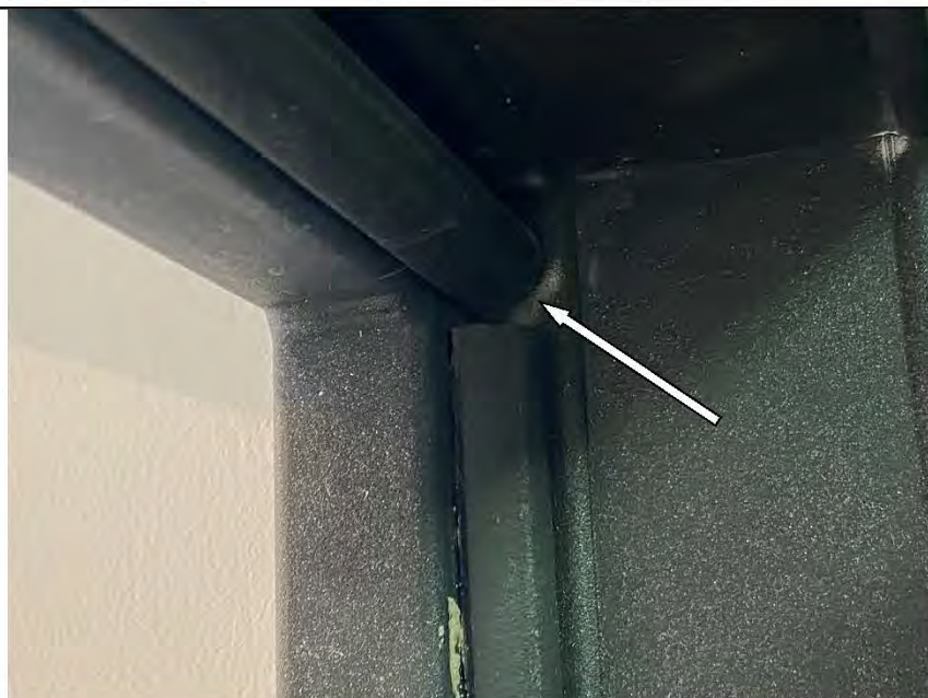
Фото №101. Дефект на уплотнительной противопожарной ленте входного дверного блока в коридоре.
