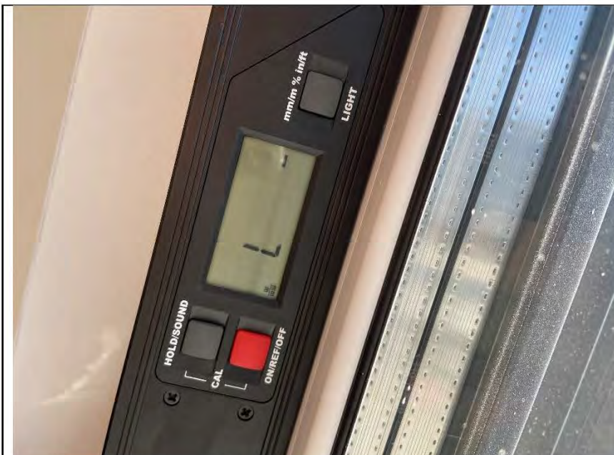
Фото №73. Отклонение по вертикали оконного блока ПВХ в кабинете.
