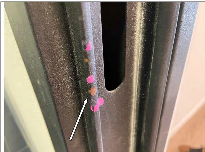
Фото №85. Дефект на коробке входного дверного блока в коридоре.
