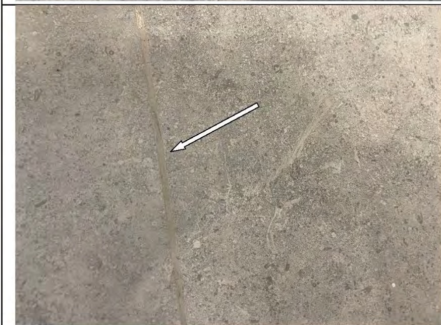
Фото №33. Неровные швы напольной керамической плитки в ванной комнате.
