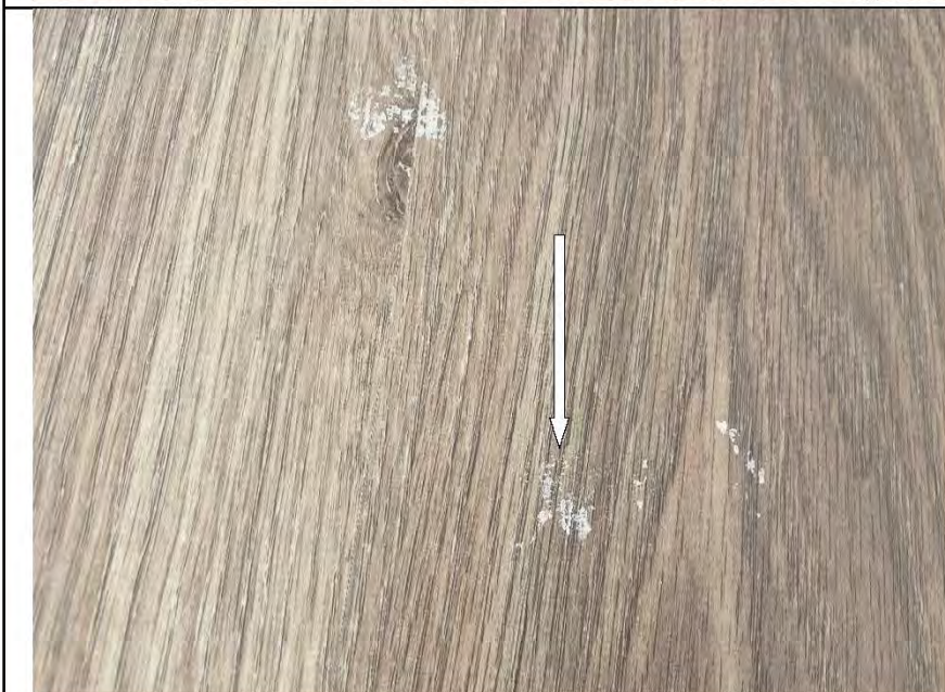
Фото №41. Дефект на напольном покрытии из ламината в кабинете.
