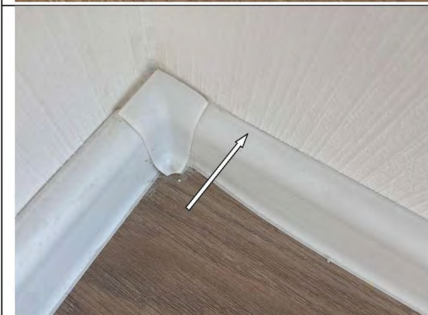
Фото №35. Дефект на напольном плинтусе ПВХ в кабинете.
