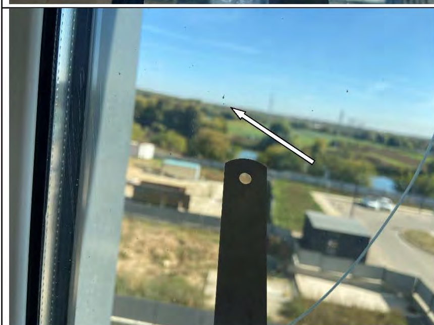
Фото №63. Царапина на стеклопакете оконного блока ПВХ в спальне.
