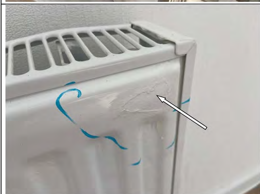
Фото №111. Дефект на поверхности металлического кожуха отопительного прибора в кабинете.
