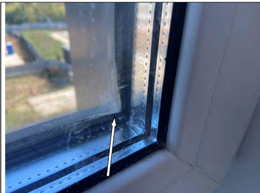
Фото №76. Дефект на уплотнительной ленте оконного блока ПВХ в кухне.
