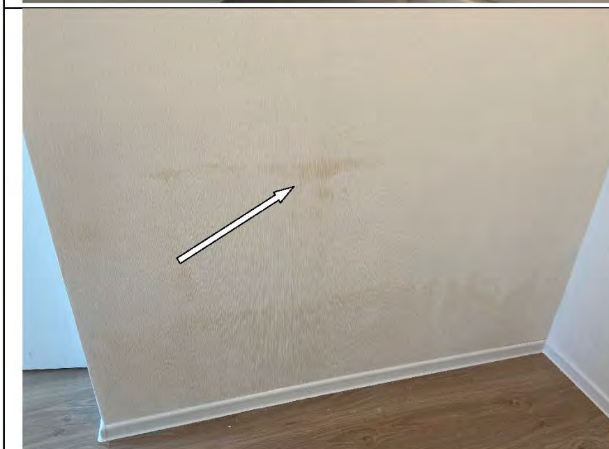
Фото №21. Следы заливания на стене, оклеенной обоями, в коридоре.
