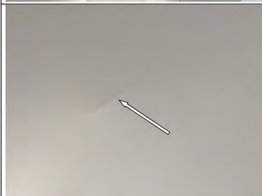
Фото №104. Дефект на поверхности натяжного потолка в кухне.
