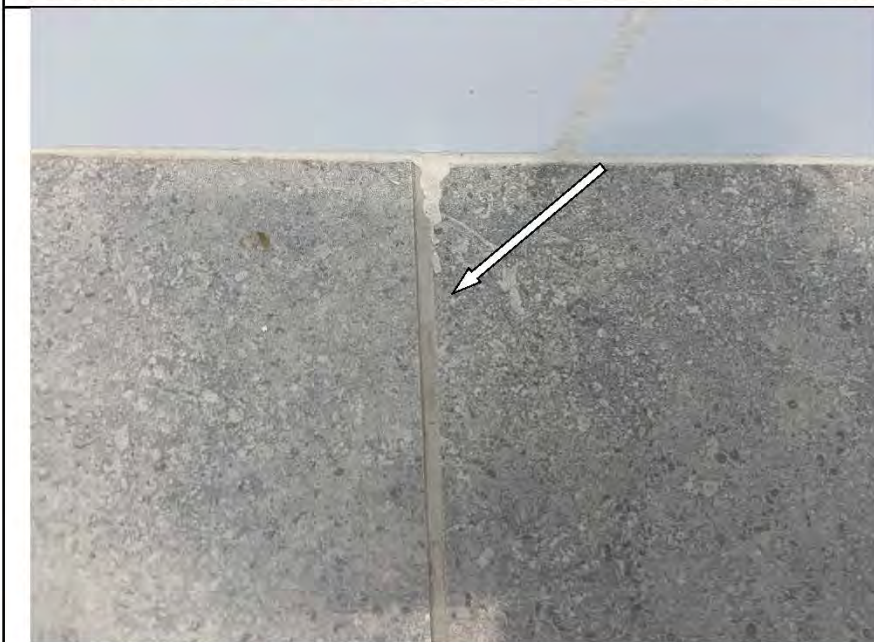
Фото №32. Неровные швы напольной керамической плитки в санузле.
