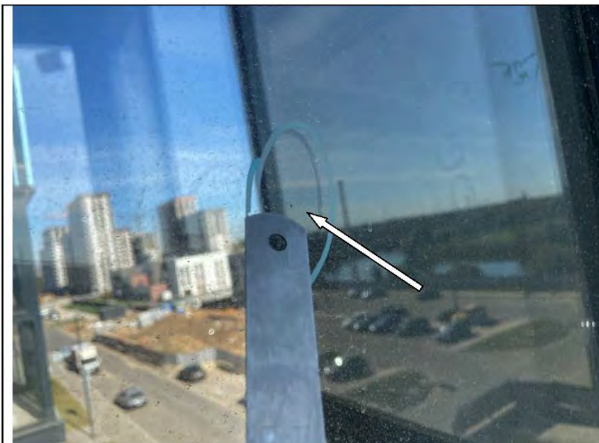
Фото №61. Окалины на стеклопакете алюминиевого оконного блока на лоджии.
