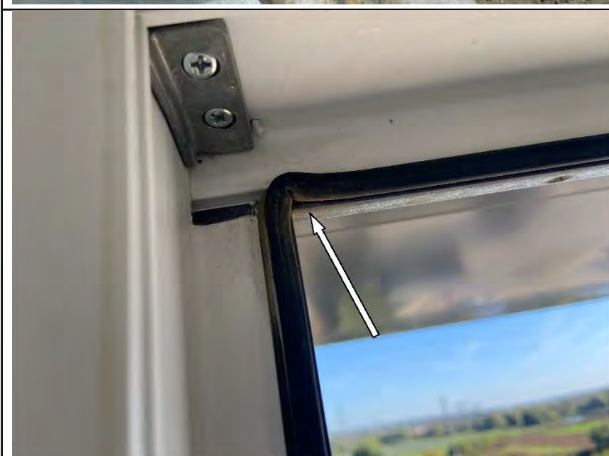
Фото №78. Дефект на уплотнительной ленте оконного блока ПВХ в спальне.
