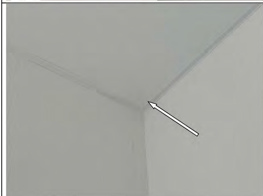
Фото №108. Дефект на поверхности натяжного потолка в кабинете.
