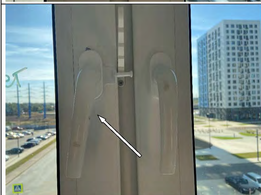
Фото №50. Не отрегулирована фурнитура оконного блока ПВХ в спальне.
