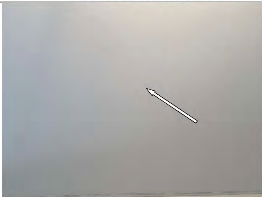
Фото №102. Дефект на поверхности натяжного потолка в коридоре.
