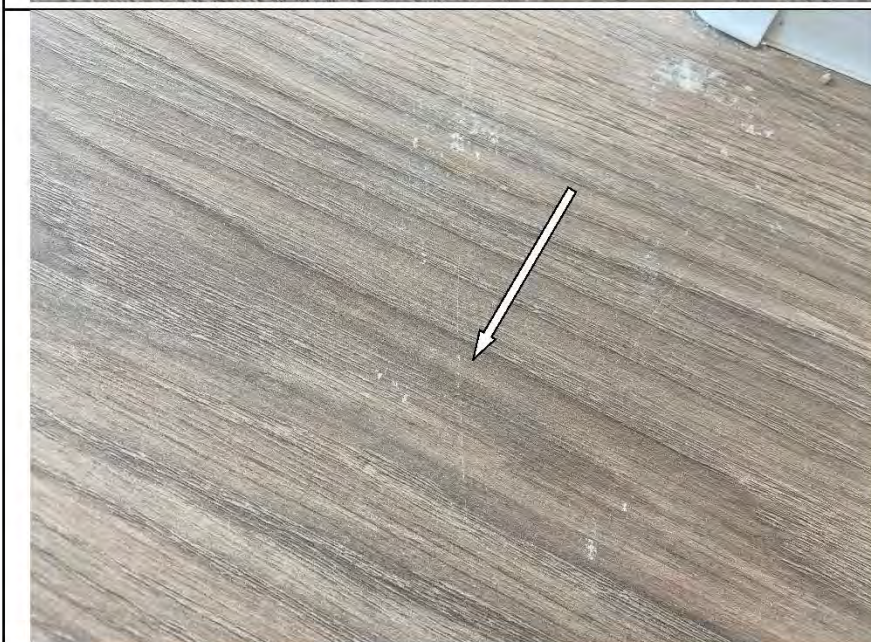
Фото №39. Дефект на напольном покрытии из ламината в кухне.
