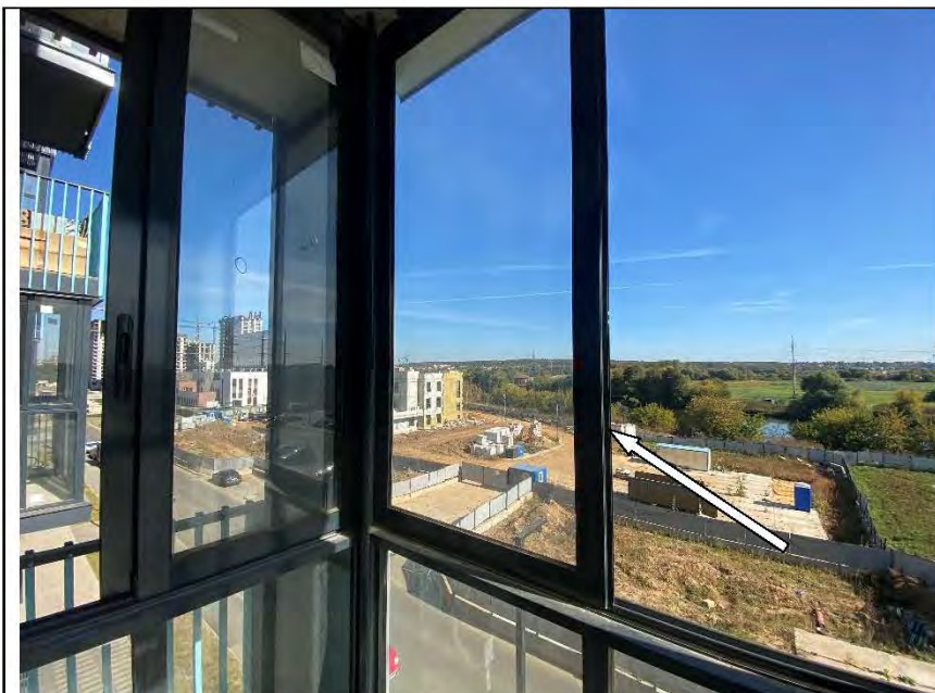
Фото №70. Не отрегулирована створка алюминиевого оконного блока на лоджии.
