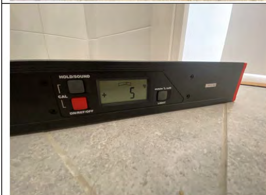
Фото №29. Отклонение поверхности напольного покрытия из керамической плитки в ванной комнате.
