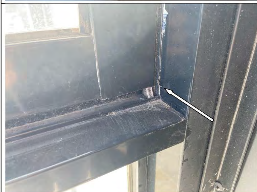
Фото №68. Дефект на металлическом профиле оконного блока на лоджии.
