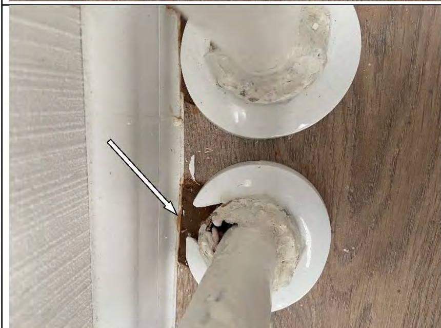
Фото №48. Дефект вставки труб отопления в напольное покрытие из ламината в спальне.
