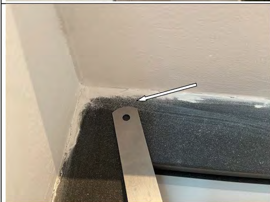
Фото №84. Дефект на коробке входного дверного блока в коридоре.
