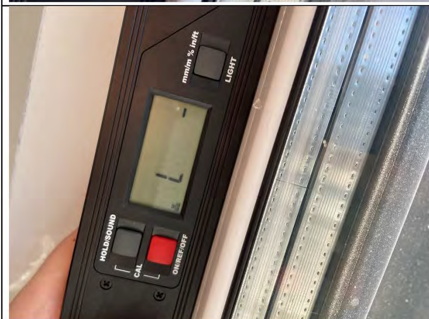
Фото №75. Отклонение по вертикали оконного блока ПВХ в спальне.
