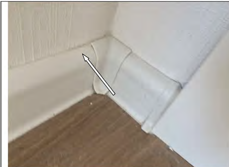
Фото №37. Дефект на напольном плинтусе ПВХ в спальне.
