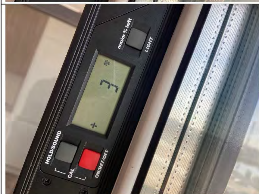
Фото №72. Отклонение по вертикали оконного блока ПВХ в кухне.
