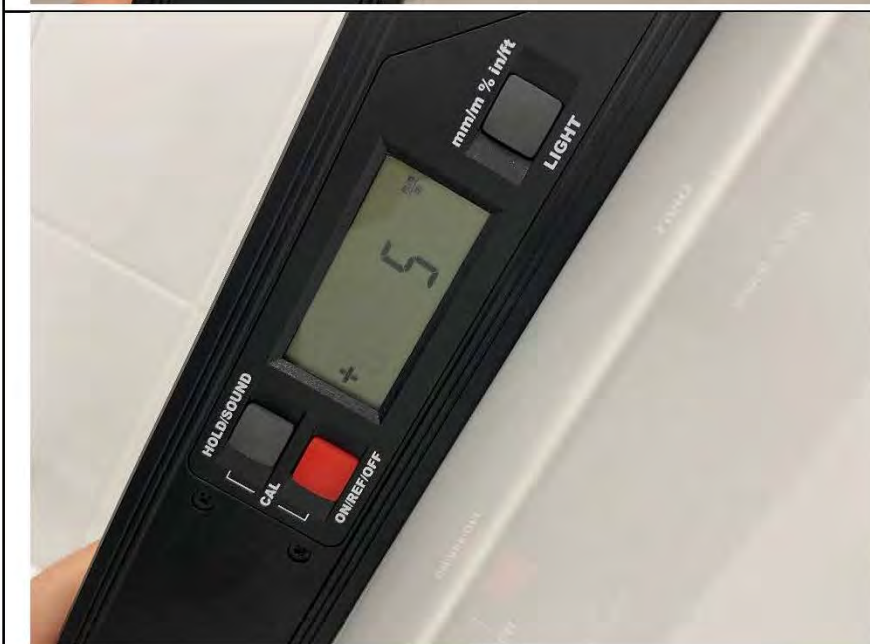
Фото №15. Отклонение поверхности стен от вертикали в ванной комнате.
