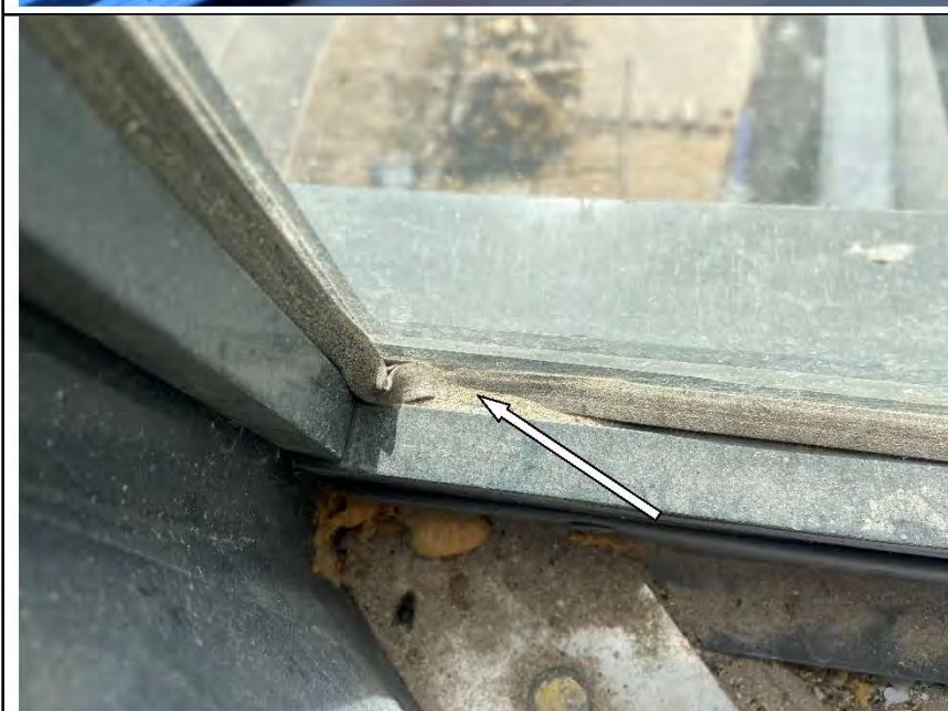
Фото №77. Дефект на уплотнительной ленте алюминиевого оконного блока на лоджии.
