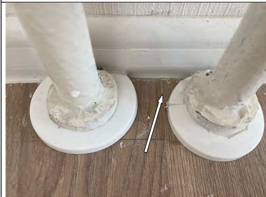
Фото №47. Дефект вставки труб отопления в напольное покрытие из ламината в спальне.
