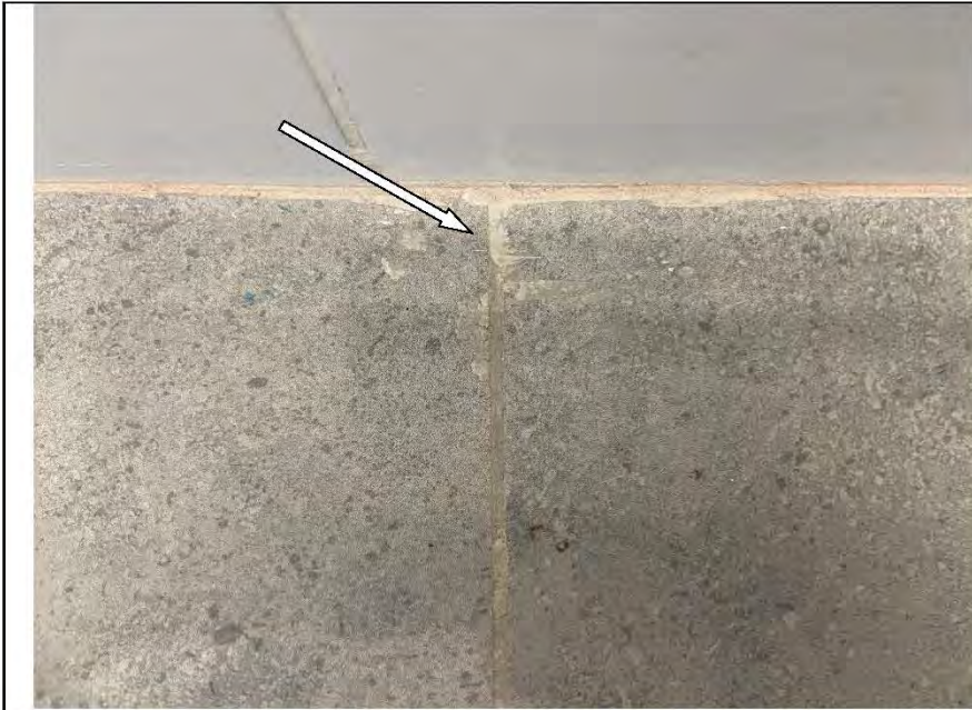
Фото №31. Загрязнения на напольной керамической плитке в ванной комнате.
