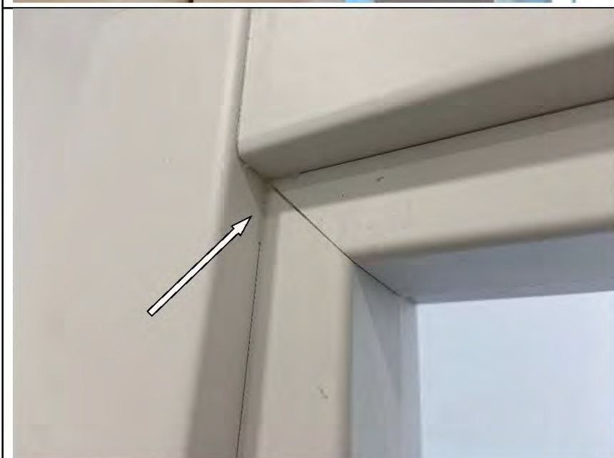
Фото №98. Дефект на коробке деревянного дверного блока в ванной комнате.
