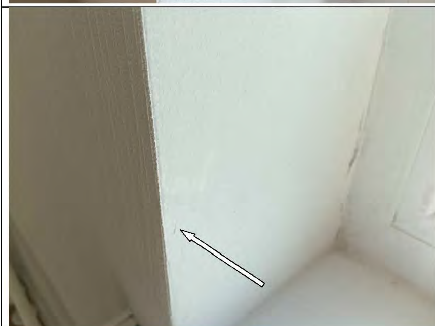
Фото №66. Неровности, выбоины, раковины на окрашенных откосах оконного блока ПВХ в кабинете.
