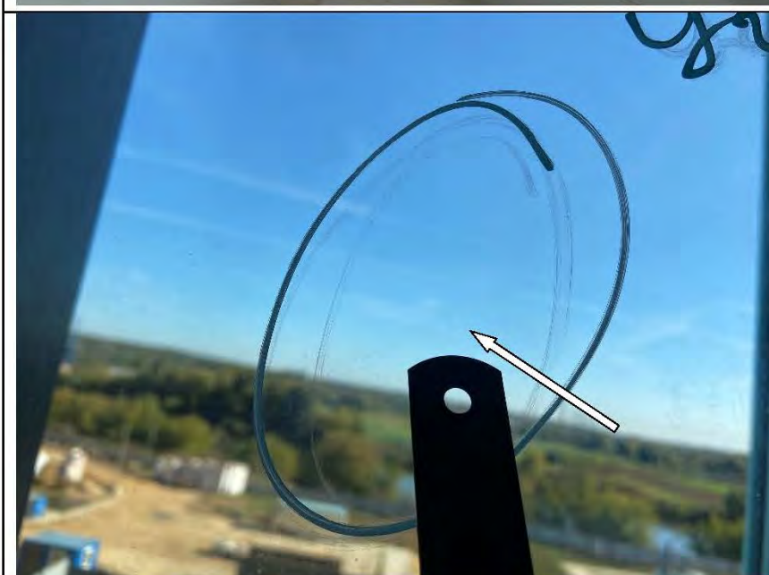
Фото №60. Царапина на стеклопакете оконного блока ПВХ в кухне.
