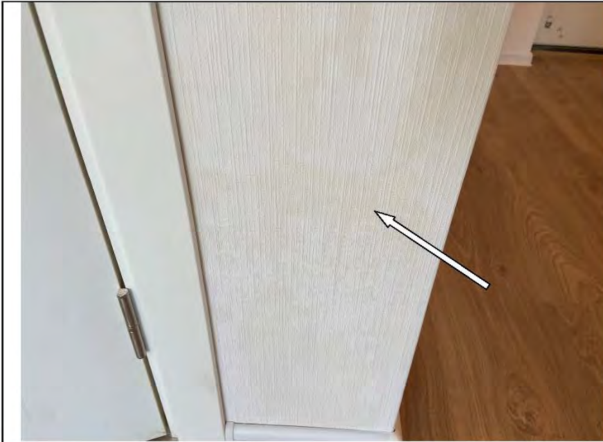
Фото №22. Следы заливания на стене, оклеенной обоями, в коридоре.
