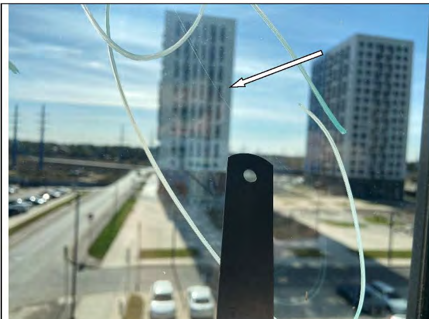
Фото №64. Царапина на стеклопакете оконного блока ПВХ в спальне.
