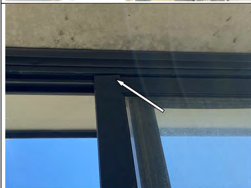
Фото №69. Дефект на металлическом профиле оконного блока на лоджии.
