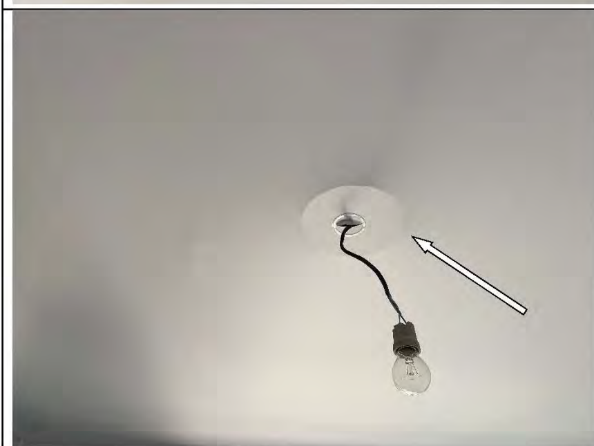
Фото №105. Дефект на поверхности натяжного потолка в кухне.
