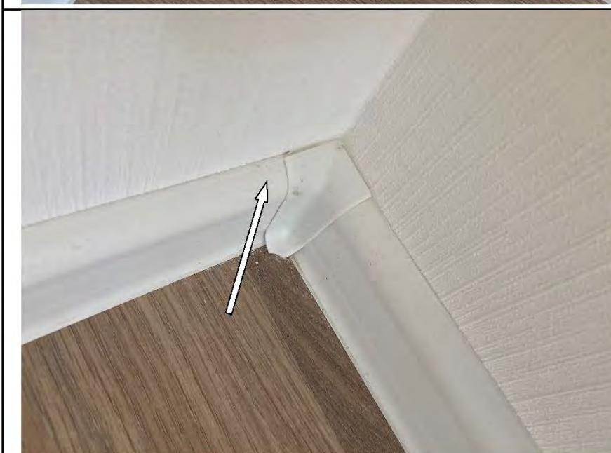
Фото №36. Дефект на напольном плинтусе ПВХ в кухне.
