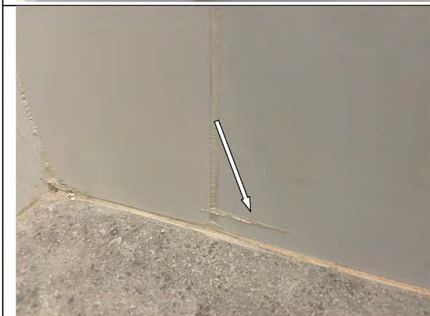
Фото №17. Загрязнения на настенной керамической плитке в ванной комнате.
