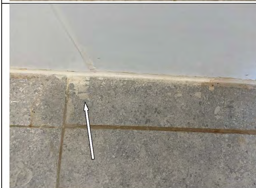
Фото №30. Загрязнения на напольной керамической плитке в санузле.
