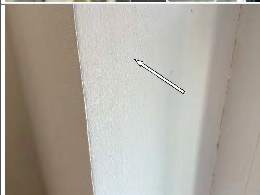
Фото №65. Неровности, выбоины, раковины на окрашенных откосах оконного блока ПВХ в кухне.
