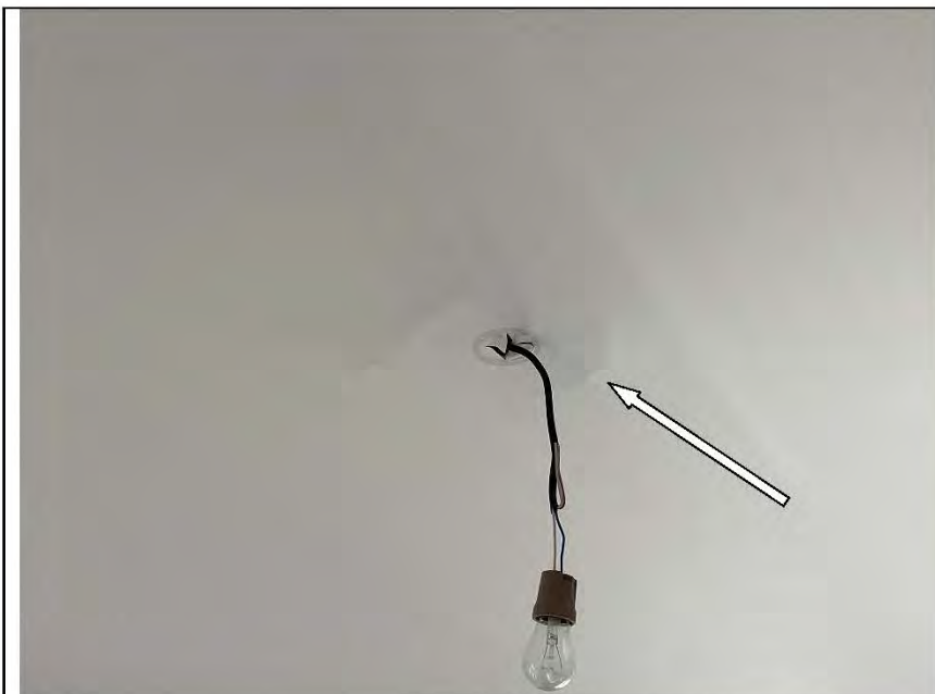
Фото №109. Дефект на поверхности натяжного потолка в спальне.
