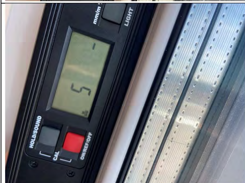
Фото №74. Отклонение по вертикали оконного блока ПВХ в спальне.
