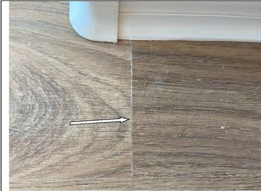
Фото №43. Поднятые кромки досок ламината в коридоре.
