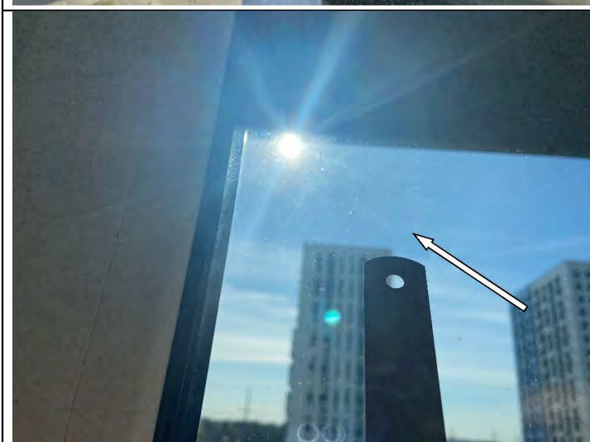
Фото №62. Царапина на стеклопакете оконного блока ПВХ в кабинете.
