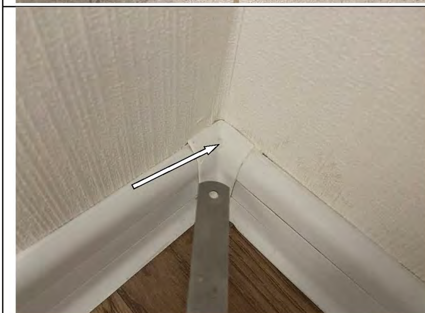
Фото №24. Дефект на напольном плинтусе ПВХ в коридоре.
