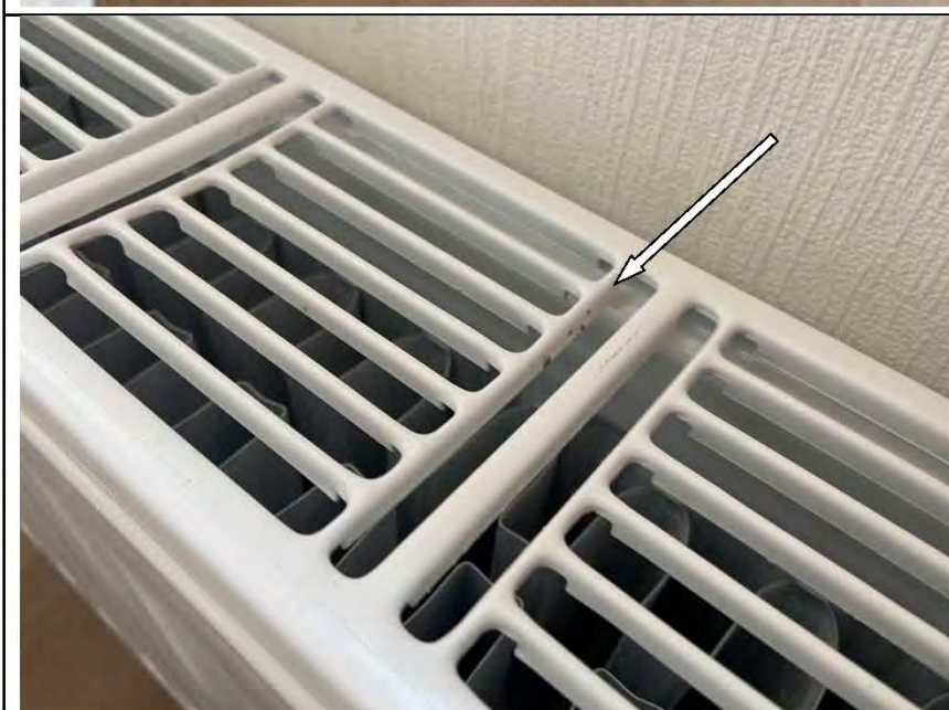
Фото №72. Дефекты на поверхности металлического кожуха отопительного прибора в кухне.
