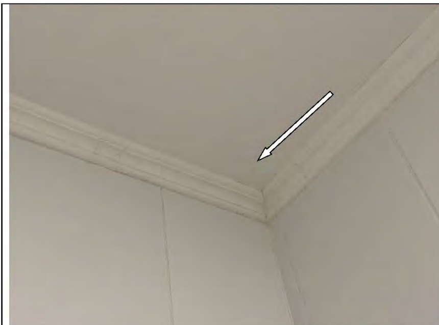
Фото №70. Дефекты на поверхности окрашенного потолка в ванной комнате.
