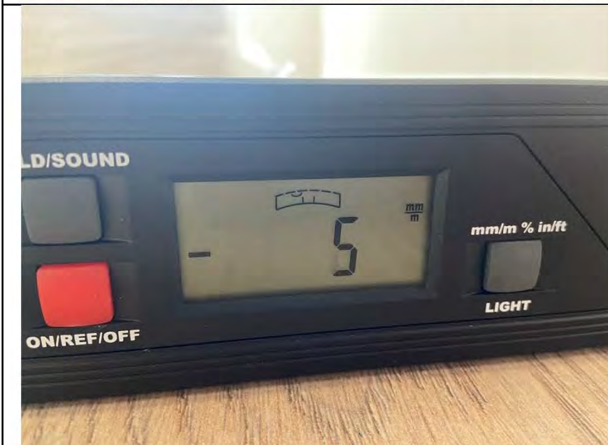
Фото №15. Отклонения поверхности напольного покрытия из ламината в спальне.
