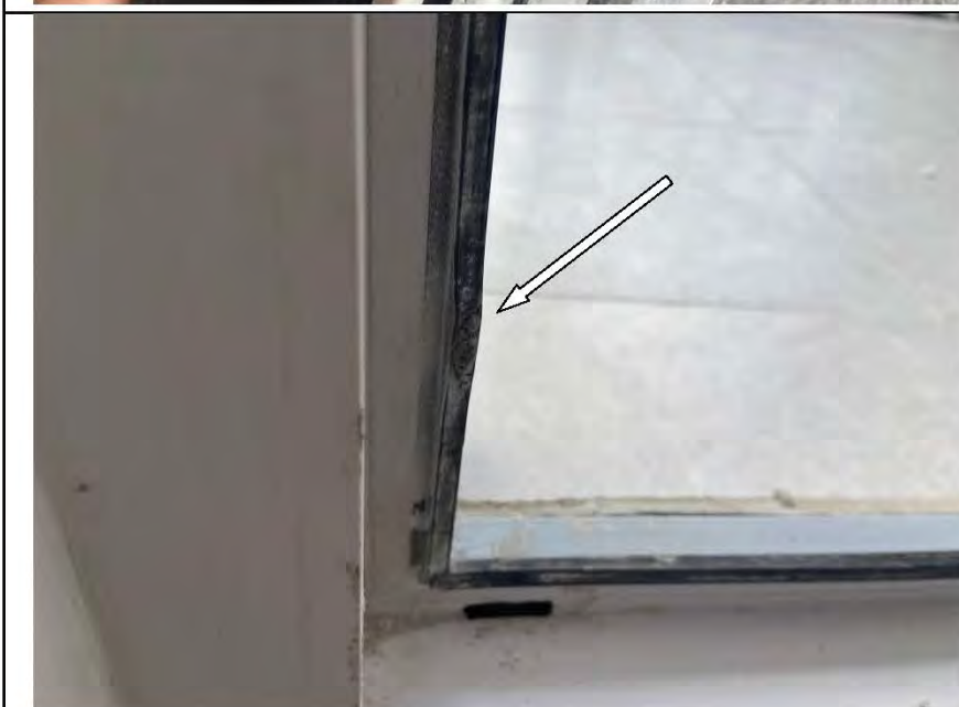
Фото №45. Дефект на уплотнительной ленте оконного блока ПВХ в спальне.
