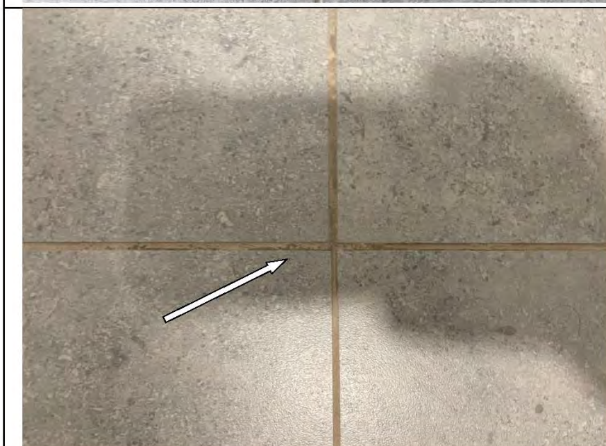
Фото №23. Неровные швы напольной керамической плитки в ванной комнате.
