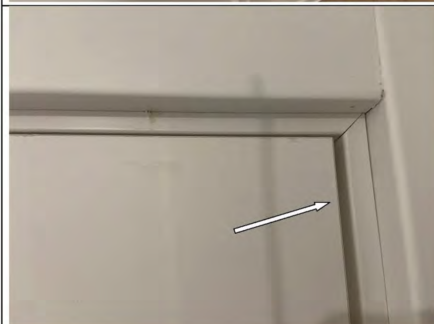
Фото №53. Свободно не закрывается/открывается дверь в ванной комнате.
