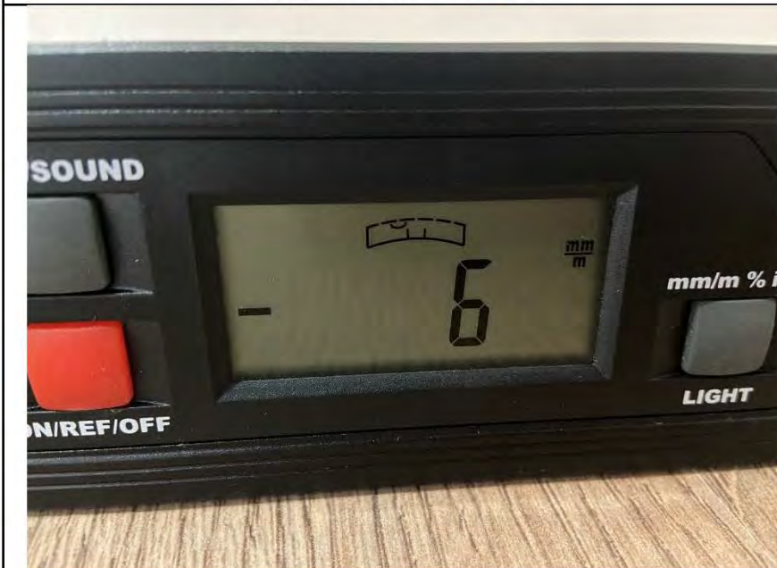
Фото №14. Отклонения поверхности напольного покрытия из ламината в коридоре.
