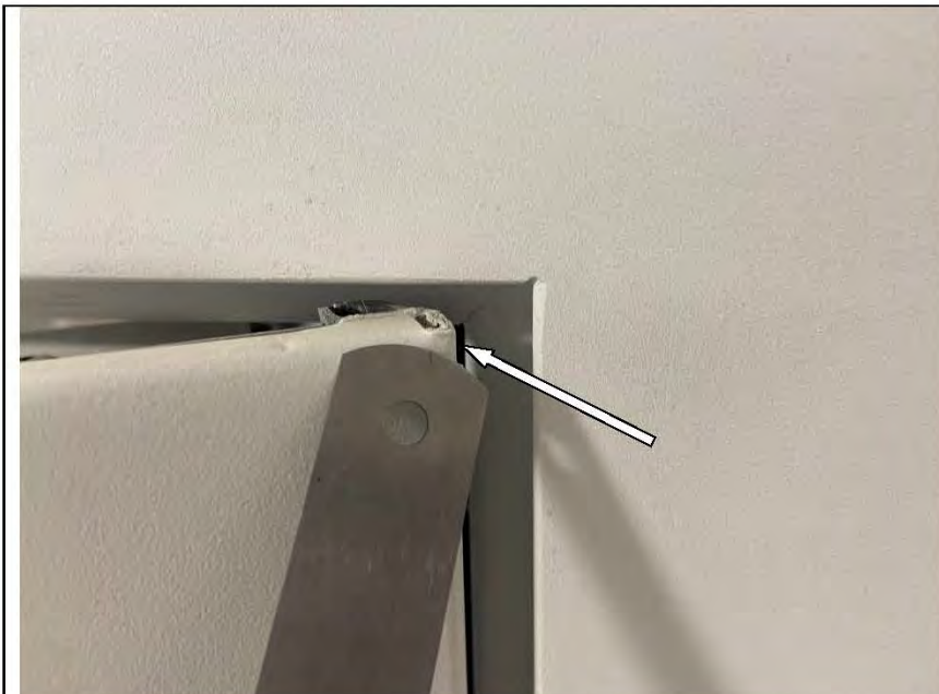
Фото №55. Дефект на полотне входного дверного блока в коридоре.
