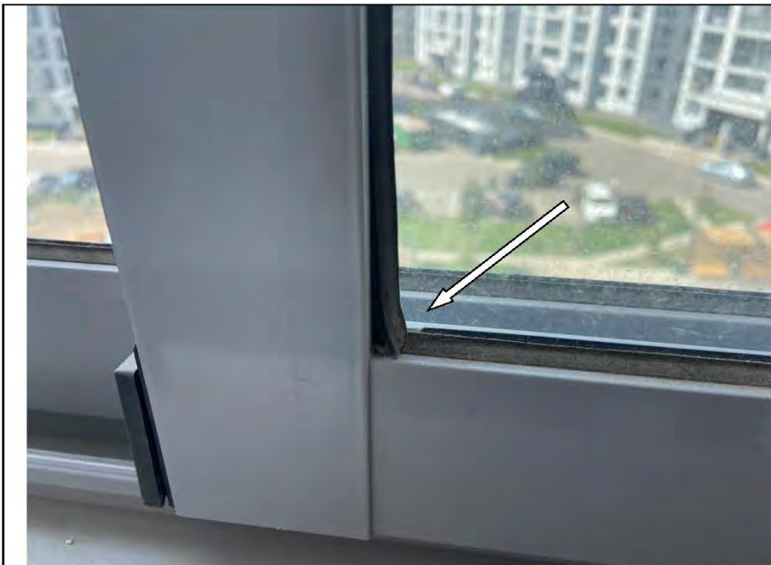
Фото №46. Дефект на уплотнительной ленте оконного блока ПВХ на лоджии.
