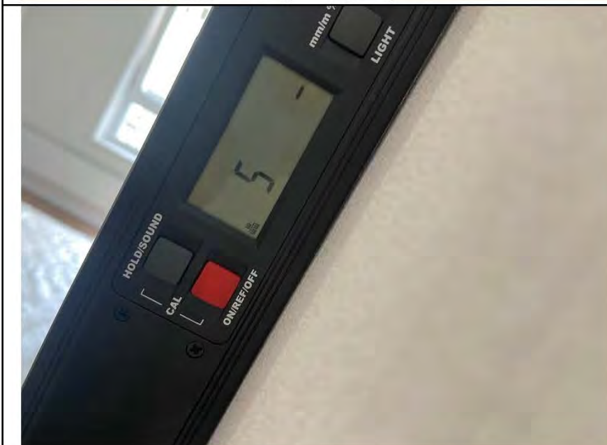
Фото №8. Отклонения поверхности стен от вертикали в спальне.
