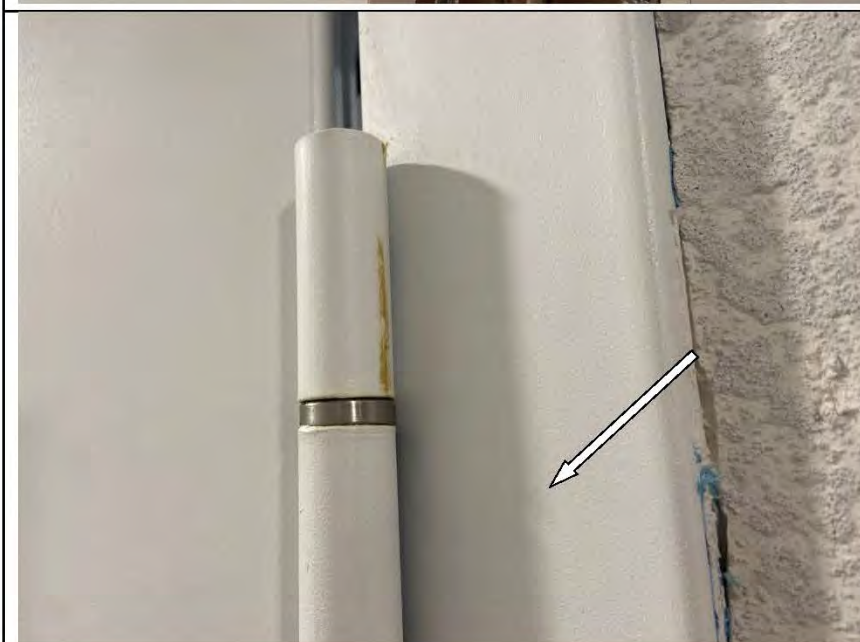
Фото №59. Дефекты на наличниках входного дверного блока в коридоре.
