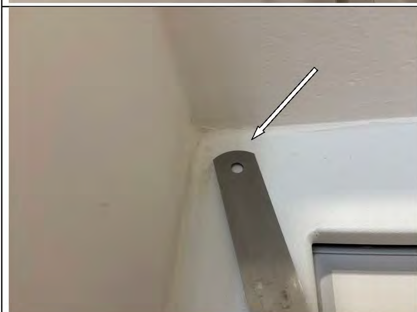
Фото №54. Дефект на коробке входного дверного блока в коридоре.
