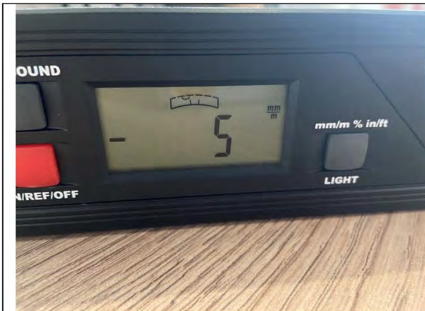
Фото №16. Отклонения поверхности напольного покрытия из ламината в кухне.
