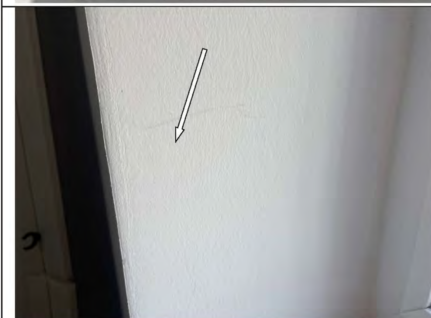
Фото №42. Неровности, выбоины, раковины на окрашенных откосах оконного блока ПВХ в кухне.
