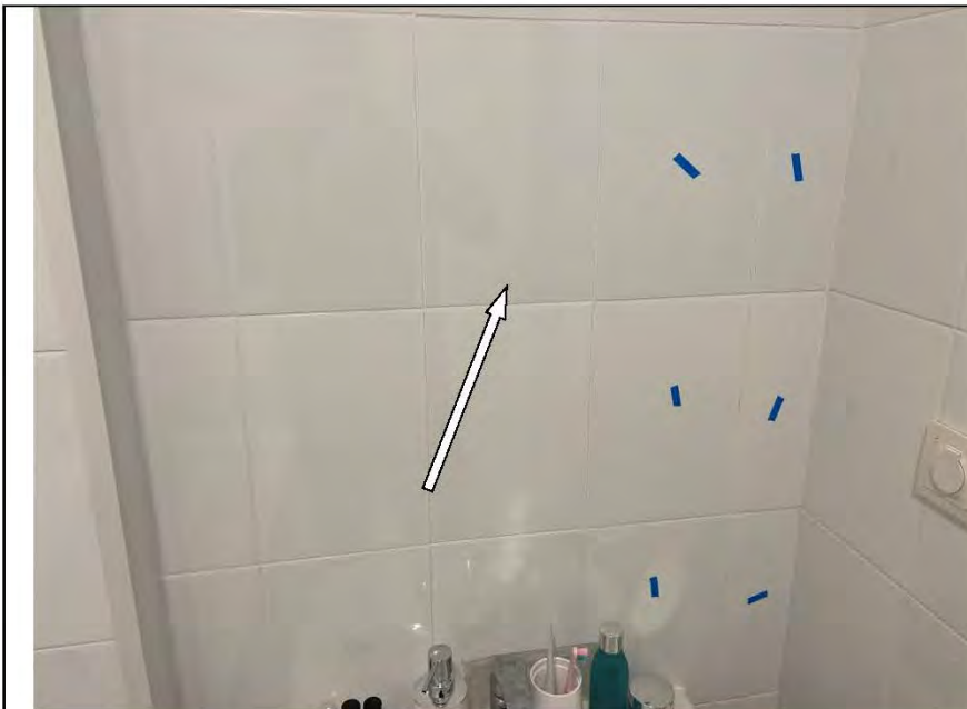
Фото №13. Разный цвет настенной керамической плитки в ванной комнате.
