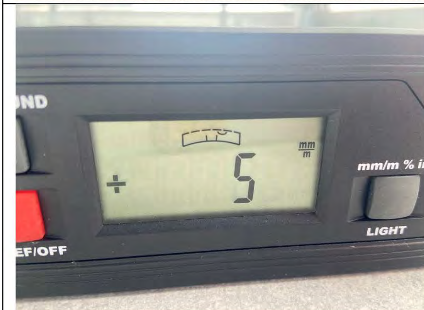
Фото №17. Отклонения поверхности напольного покрытия из керамической плитки на лоджии.
