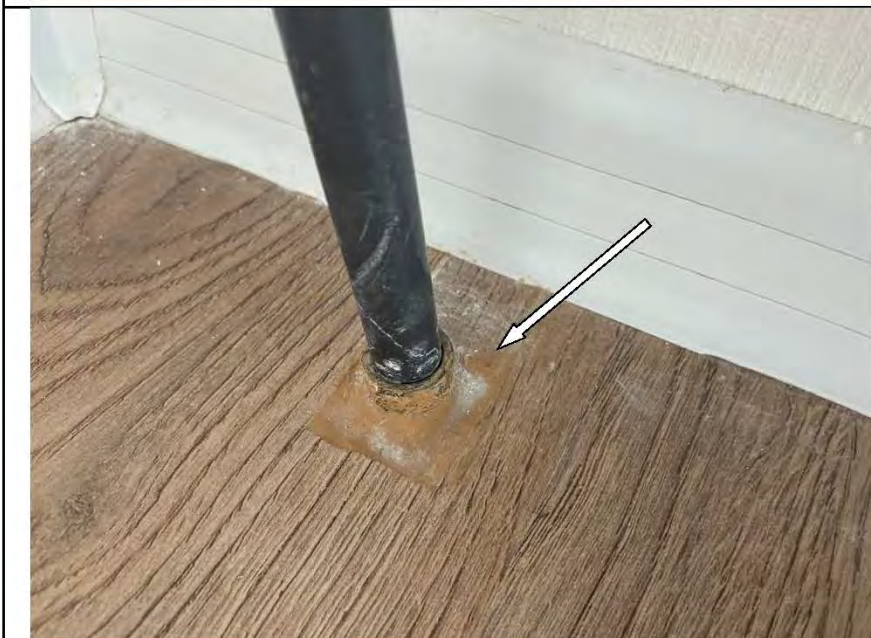
Фото №32. Дефект вставки труб отопления в напольное покрытие из ламината в спальне.
