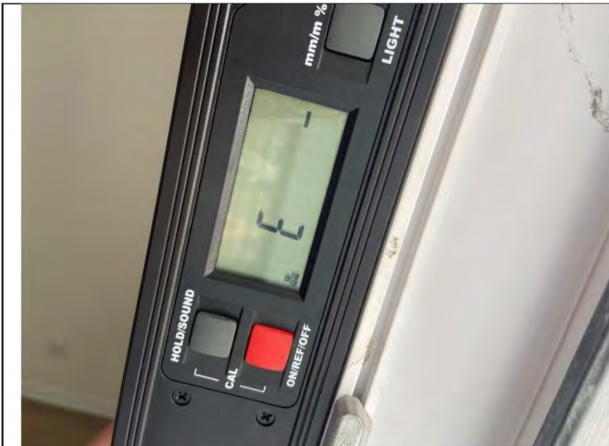
Фото №43. Отклонения от вертикали оконного блока ПВХ в спальне.
