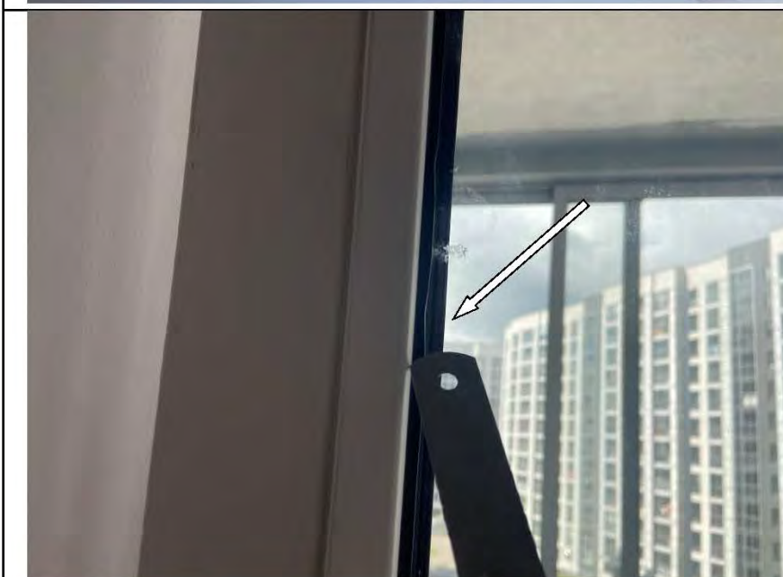
Фото №38. Царапина на стеклопакете оконного блока ПВХ в спальне.
