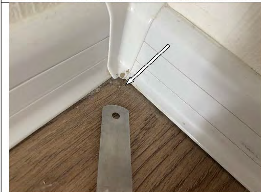
Фото №29. Дефект на напольном покрытии из ламината в спальне.
