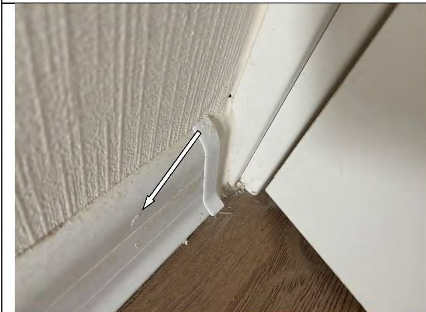
Фото №27. Дефект на напольном плинтусе ПВХ в кухне.
