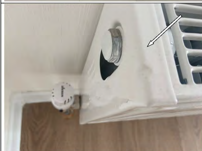
Фото №71. Дефекты на поверхности металлического кожуха отопительного прибора в спальне.
