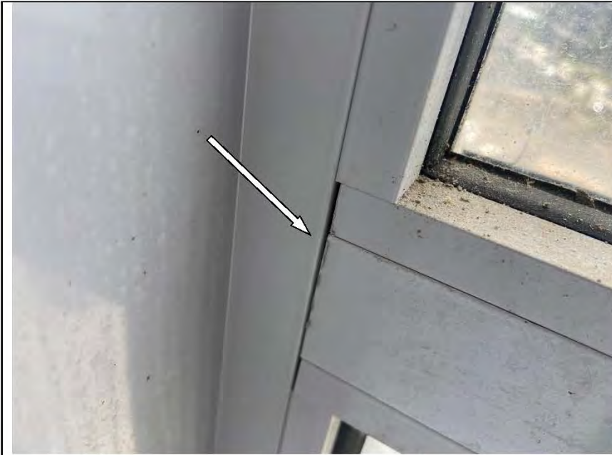
Фото №49. Дефект на металлическом профиле оконного блока на лоджии.
