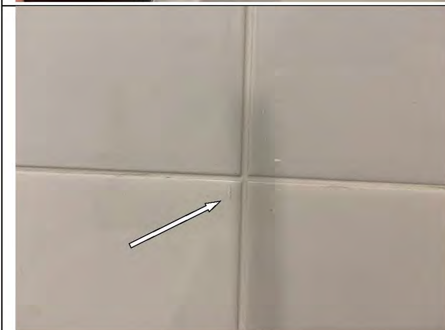
Фото №11. Загрязнения на настенной керамической плитке в ванной комнате.
