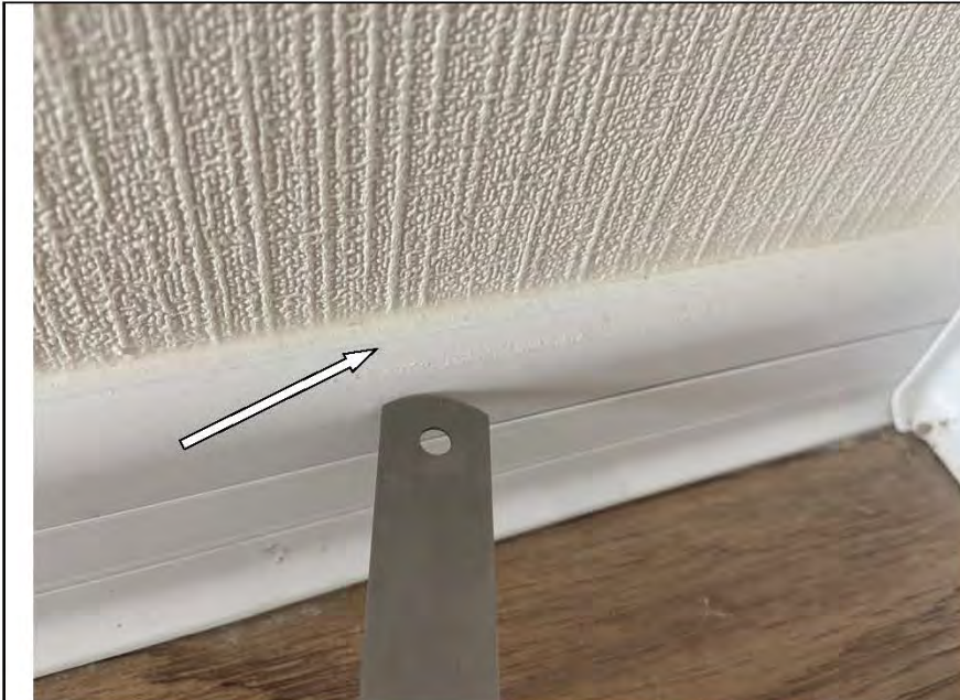
Фото №25. Дефект на напольном плинтусе ПВХ в спальне.
