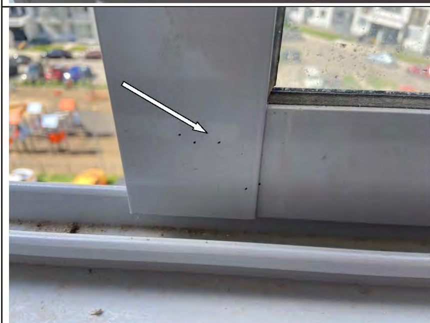
Фото №48. Дефект на металлическом профиле оконного блока на лоджии.
