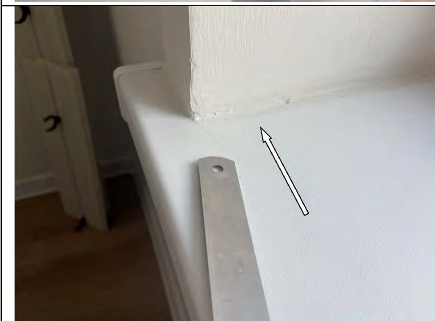
Фото №35. Дефект на лицевой стороне подоконной доски в кухне.
