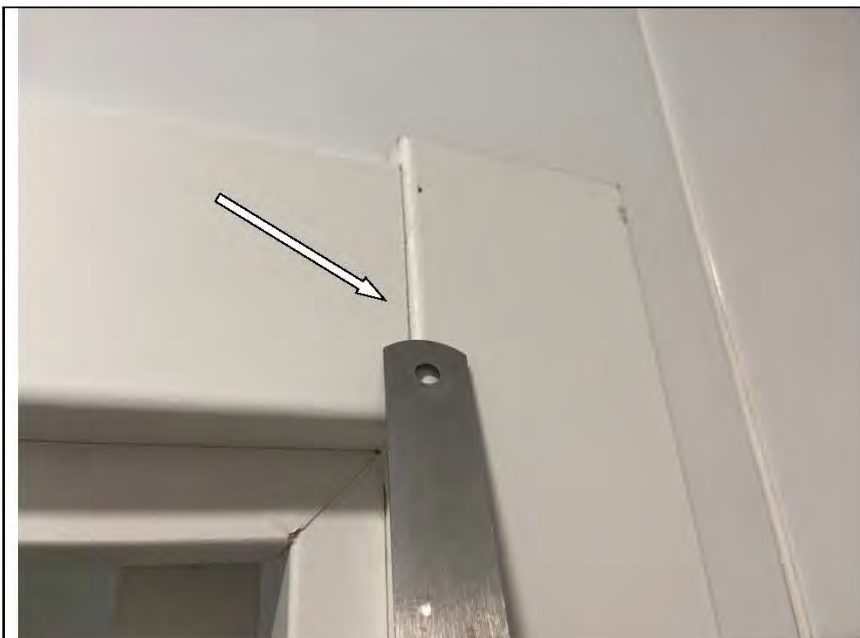
Фото №61. Дефекты на наличниках деревянного дверного блока в ванной комнате.
