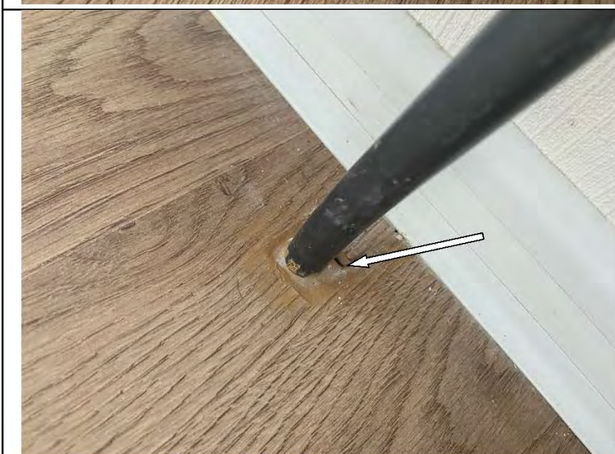
Фото №33. Дефект вставки труб отопления в напольное покрытие из ламината в кухне.
