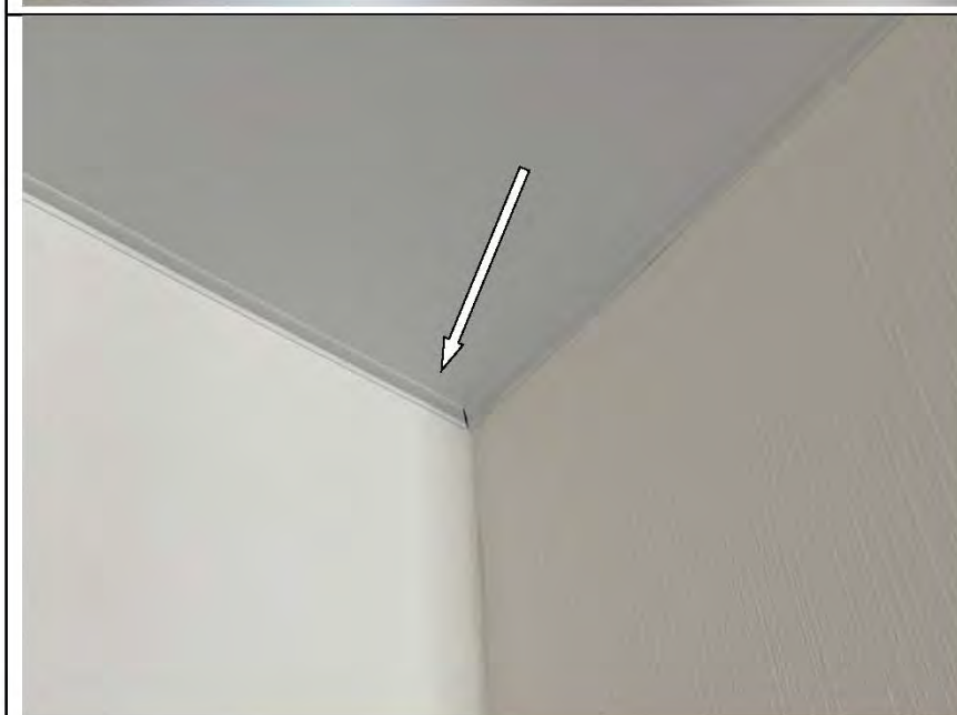
Фото №68. Дефекты на поверхности натяжного потолка в кухне.
