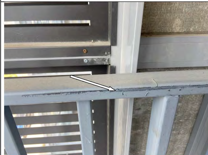
Фото №50. Дефект на металлическом ограждении на лоджии.
