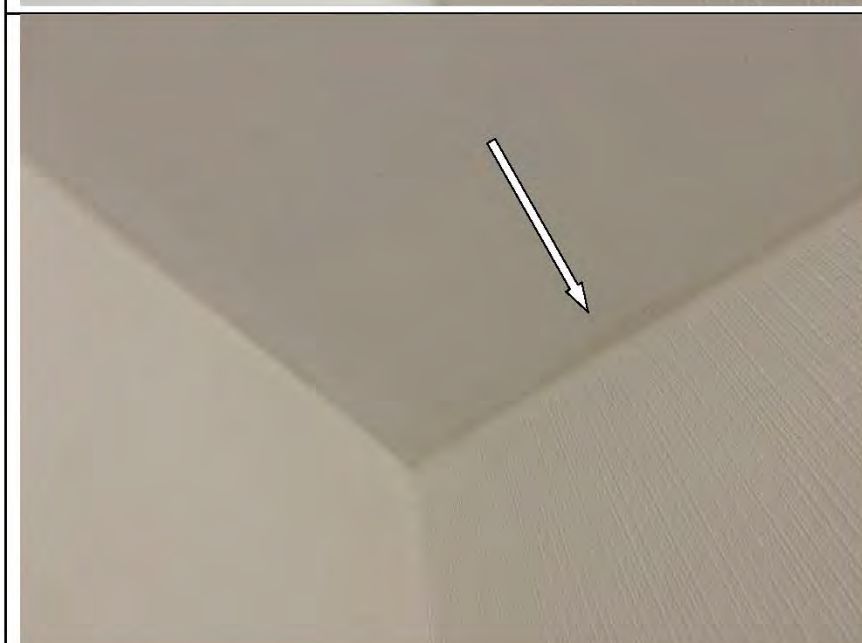
Фото №69. Дефекты на поверхности окрашенного потолка в коридоре.
