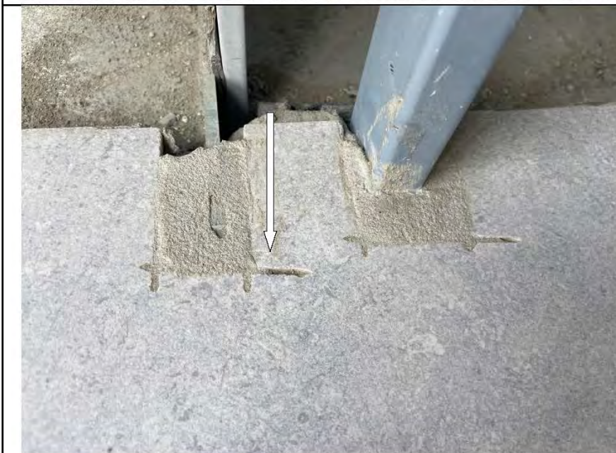
Фото №20. Механическое повреждение напольной керамической плитки на лоджии.
