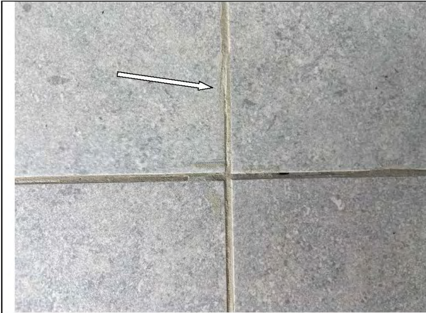
Фото №19. Загрязнения на напольной керамической плитке на лоджии.
