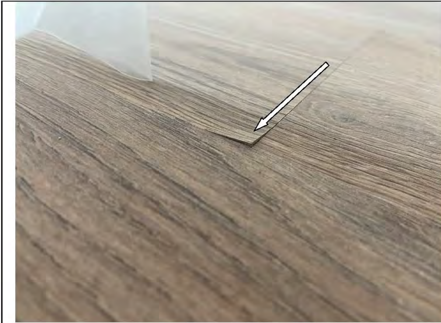
Фото №31. Поднятые кромки ламината в коридоре.
