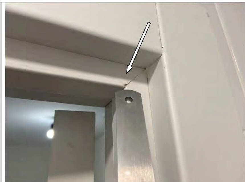
Фото №64. Дефект на коробке деревянного дверного блока в ванной комнате.
