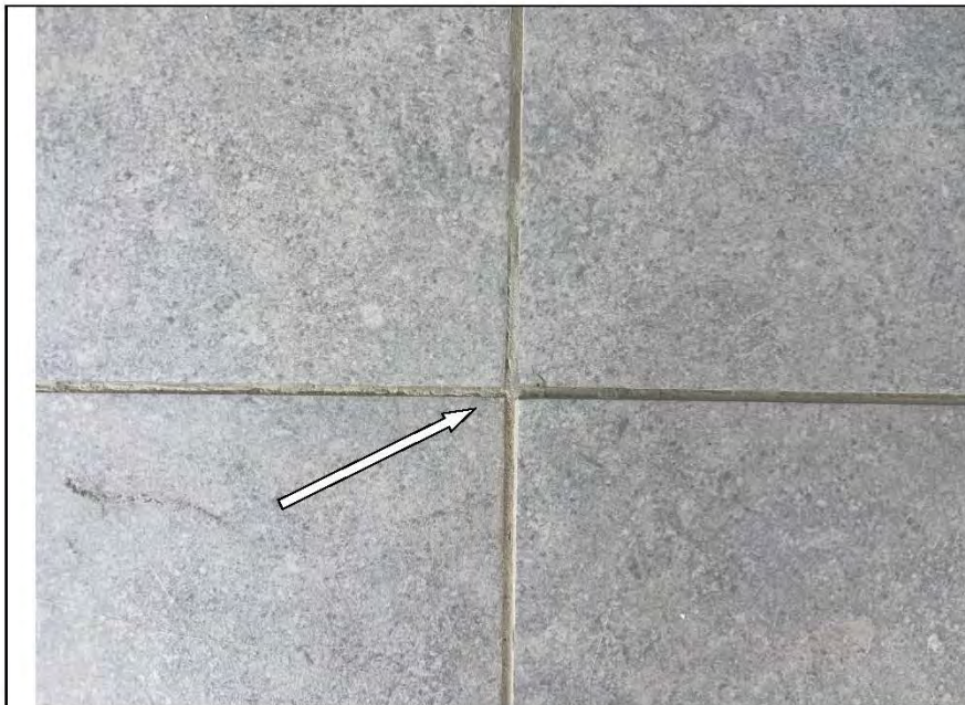
Фото №22. Неровные швы напольной керамической плитки на лоджии.
