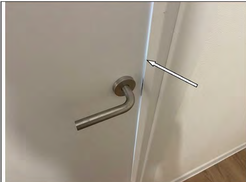
Фото №52. Свободно не закрывается/открывается дверь в спальне.
