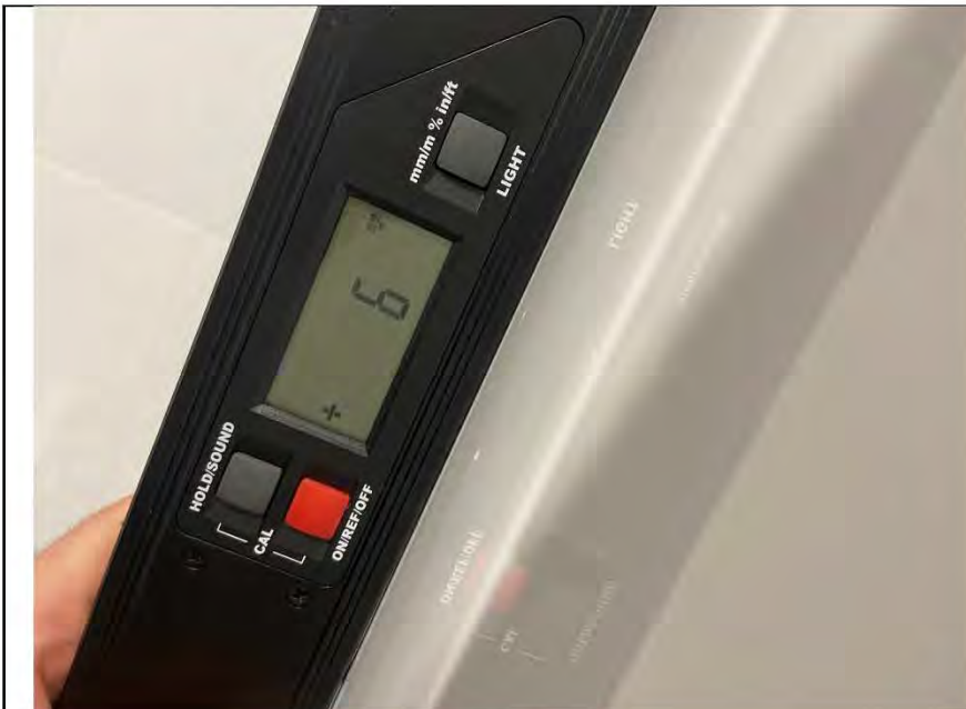
Фото №10. Отклонения поверхности стен от вертикали в ванной комнате.
