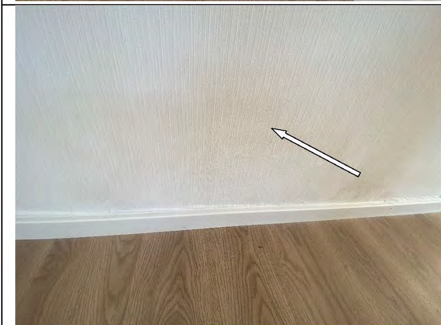
Фото №12. Следы залития на стенах, оклеенных обоями, в жилой комнате №1.
