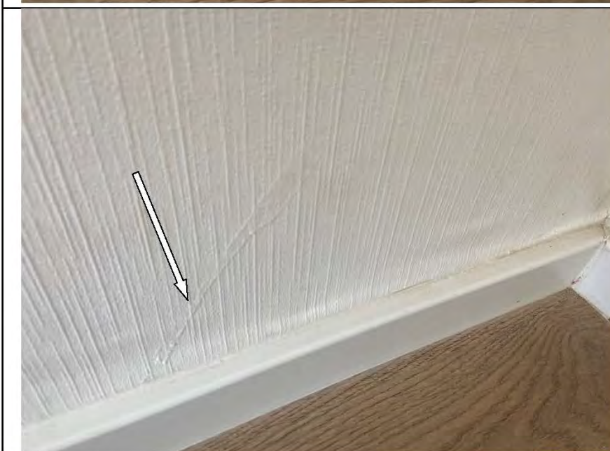
Фото №39. Следы заливания на стенах, оклеенных обоями, в жилой комнате №2.
