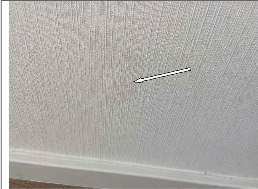
Фото №43. Следы залития на стенах, оклеенных обоями, в жилой комнате №2.
