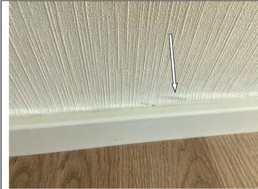
Фото №34. Следы залития на стенах, оклеенных обоями, в кухне.
