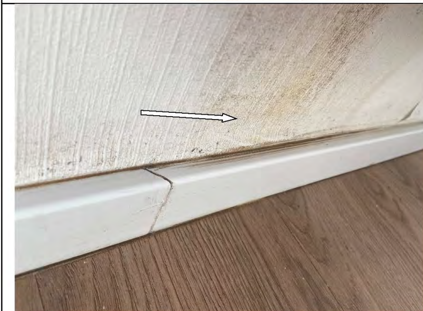
Фото №17. Следы заливания и плесени на стенах, оклеенных обоями, в жилой комнате №1.
