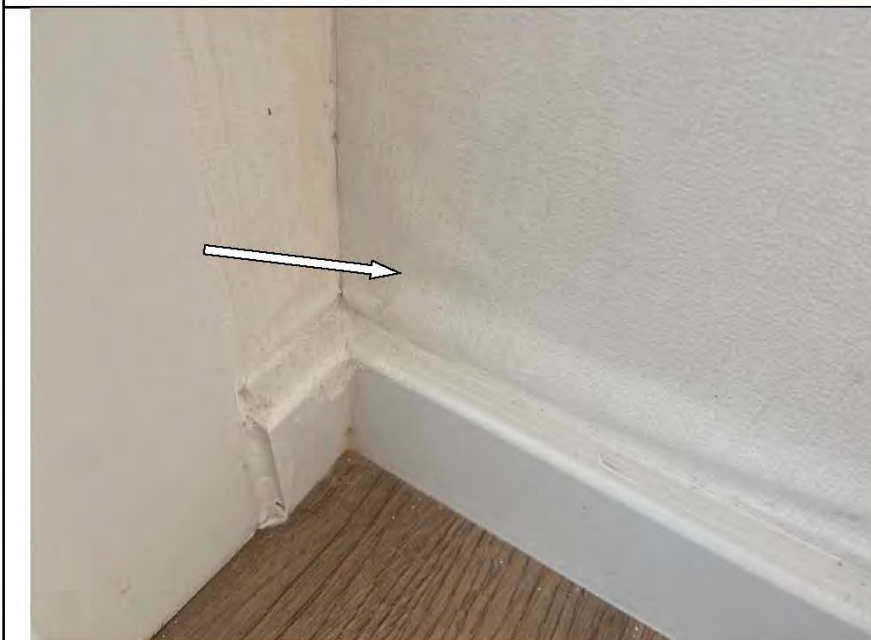
Фото №20. Следы залития на стенах, оклеенных обоями, в коридоре.
