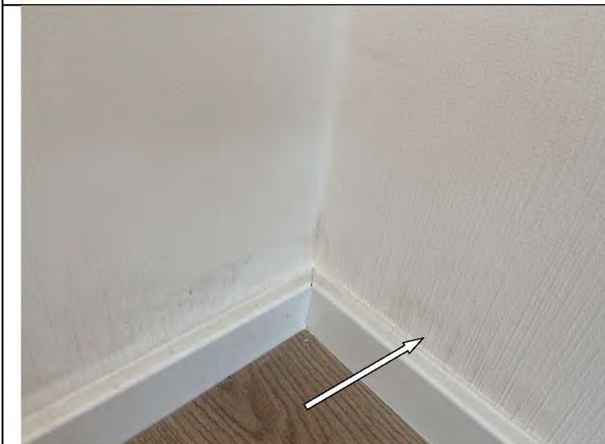
Фото №44. Следы залития на стенах, оклеенных обоями, в жилой комнате №2.
