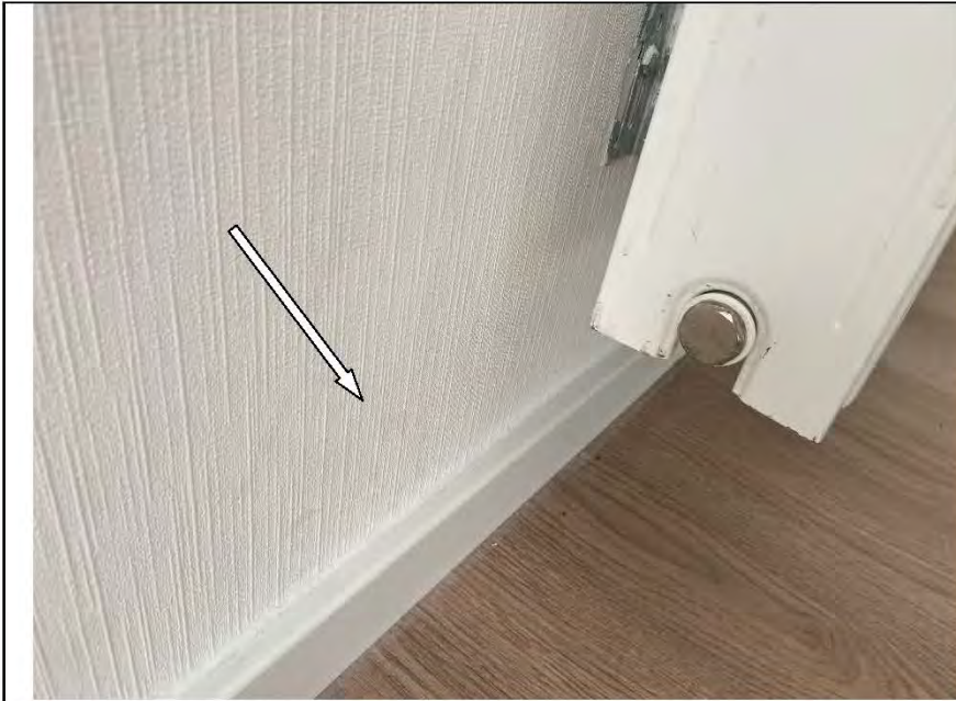
Фото №31. Следы залития на стенах, оклеенных обоями, в кухне.
