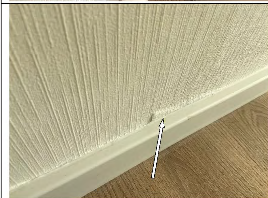
Фото №33. Следы залития на стенах, оклеенных обоями, в кухне.
