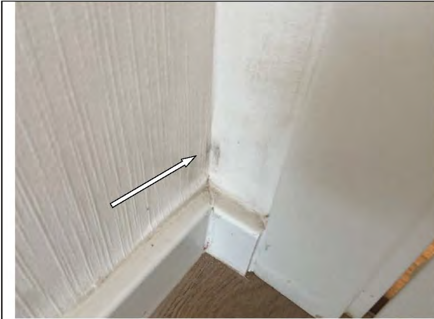
Фото №37. Следы заливания и плесени на стенах, оклеенных обоями, в жилой комнате №2.
