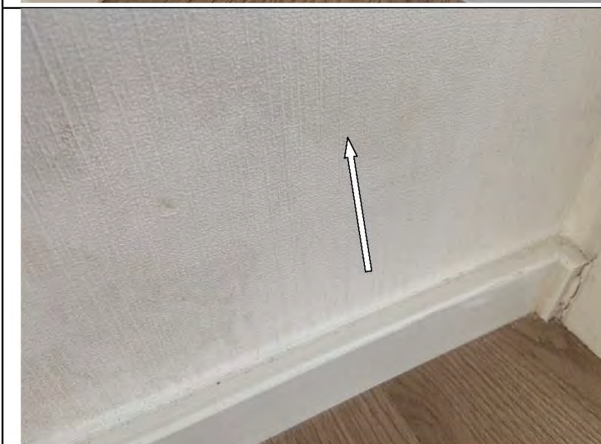
Фото №21. Следы залития на стенах, оклеенных обоями, в коридоре.
