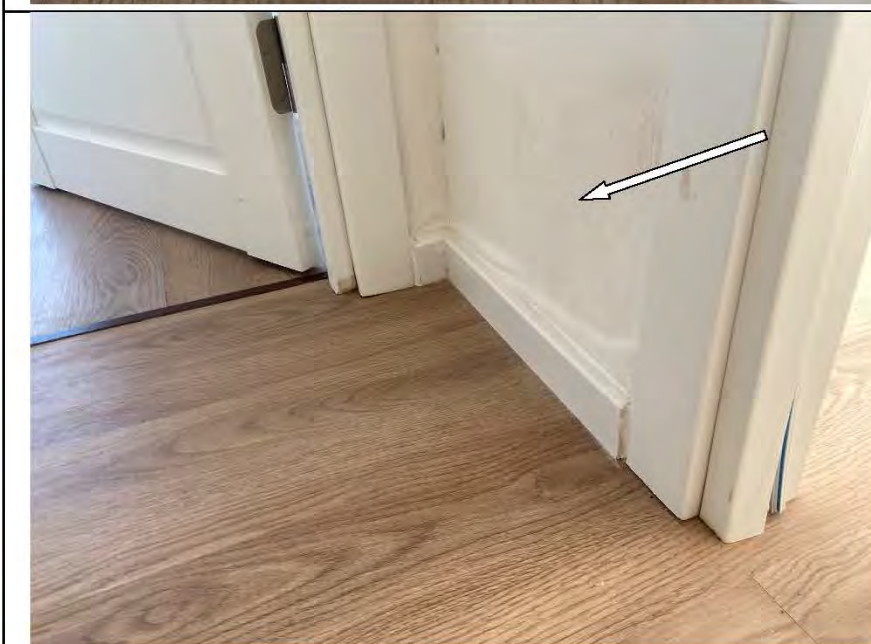
Фото №36. Следы залития на стенах, оклеенных обоями, в кухне.
