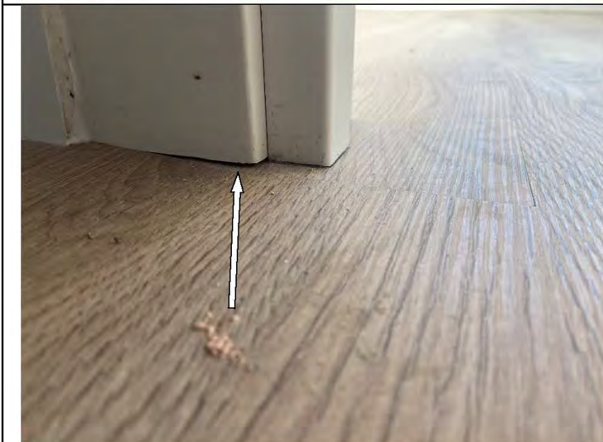
Фото №66. Следы залития на наличниках деревянного дверного блока в кухне.
