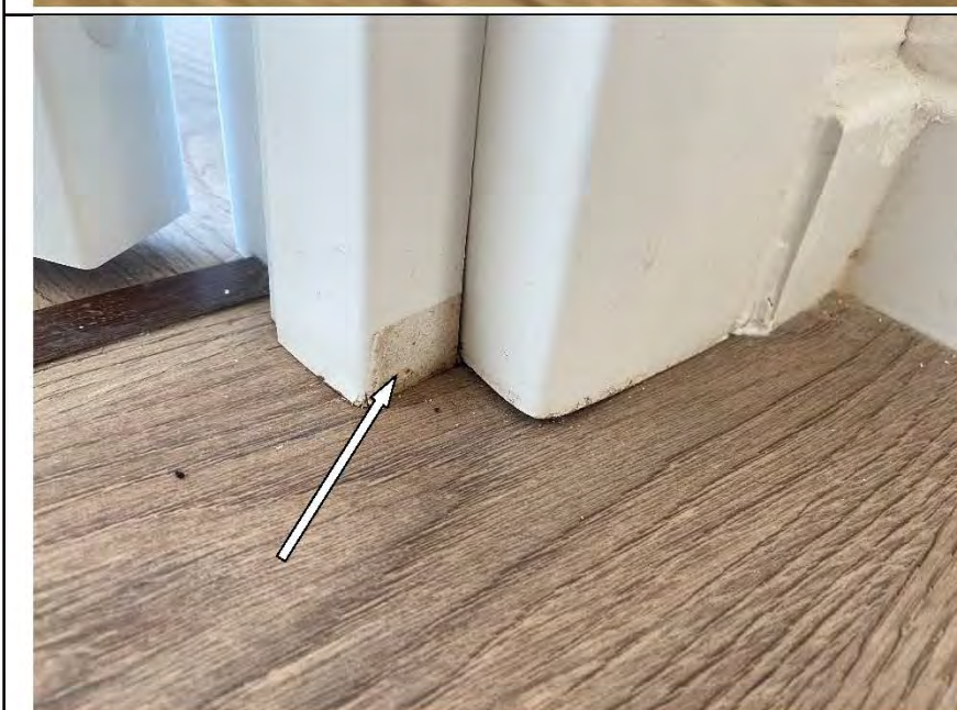
Фото №60. Следы залития на коробке деревянного дверного блока в жилой комнате №2.
