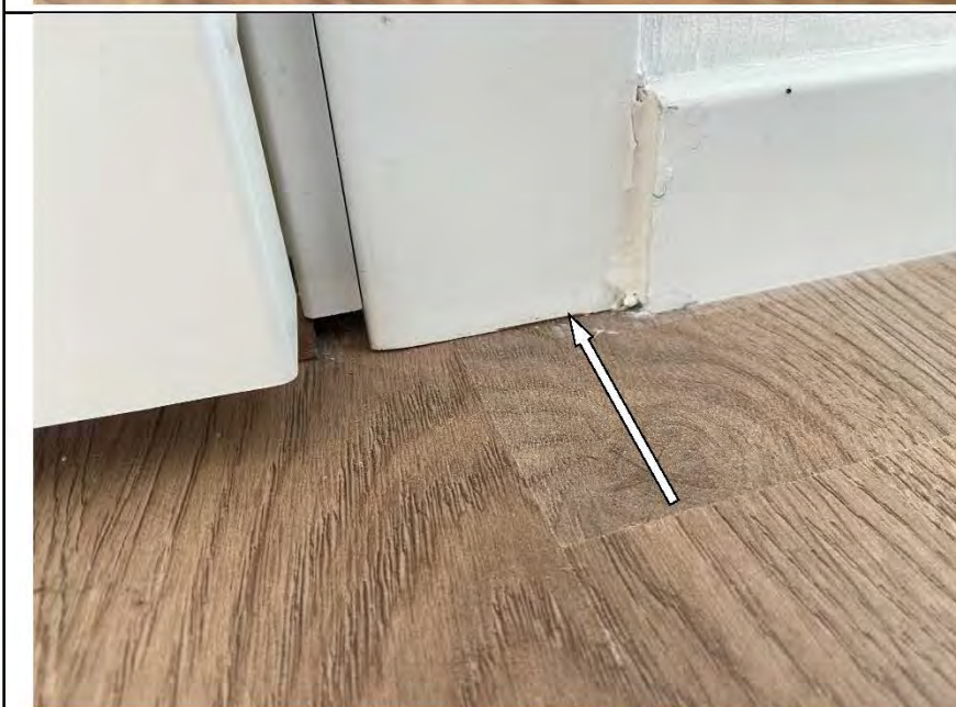
Фото №63. Следы залития на наличниках деревянного дверного блока в жилой комнате №1.
