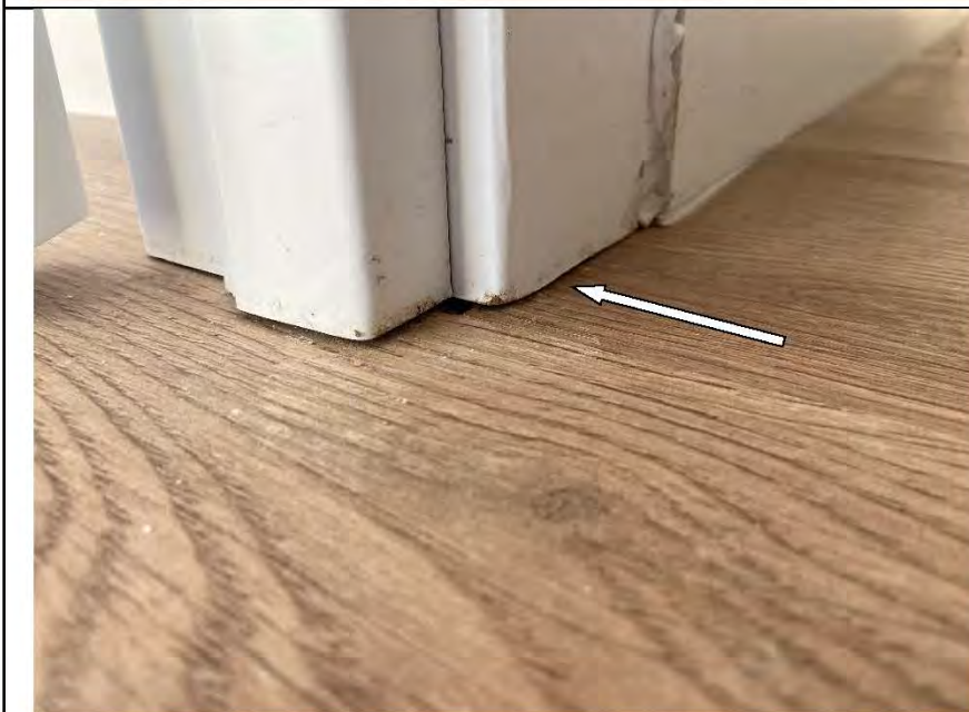
Фото №62. Следы залития на наличниках деревянного дверного блока в жилой комнате №2.
