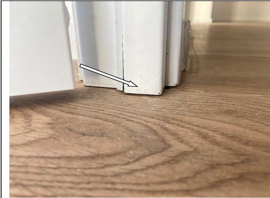
Фото №61. Следы залития на коробке деревянного дверного блока в жилой комнате №2.
