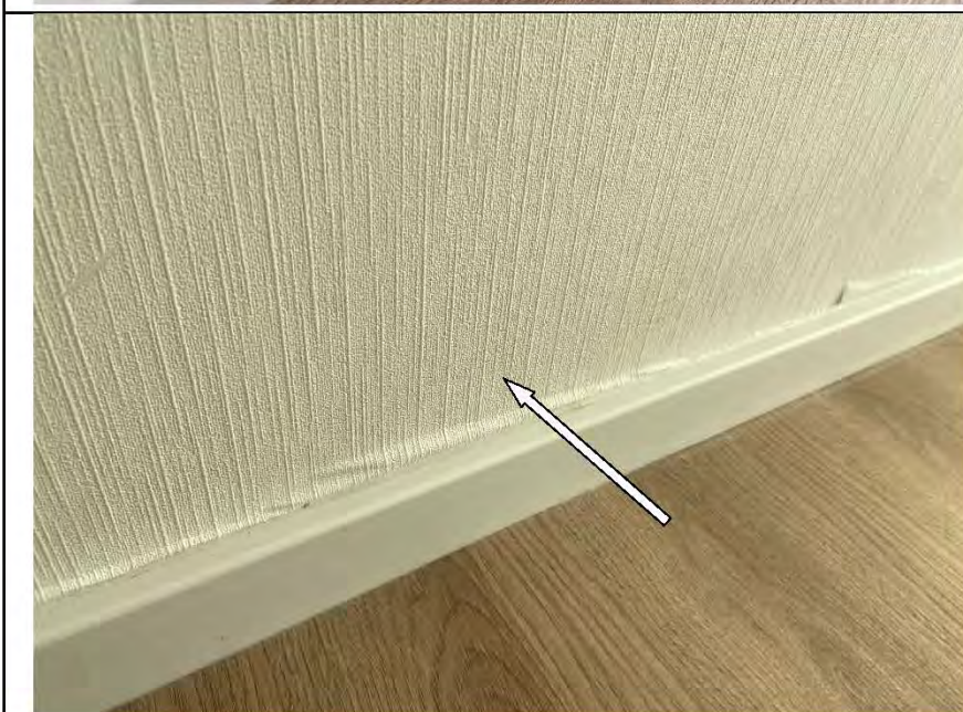
Фото №27. Следы залития на стенах, оклеенных обоями, в кухне.
