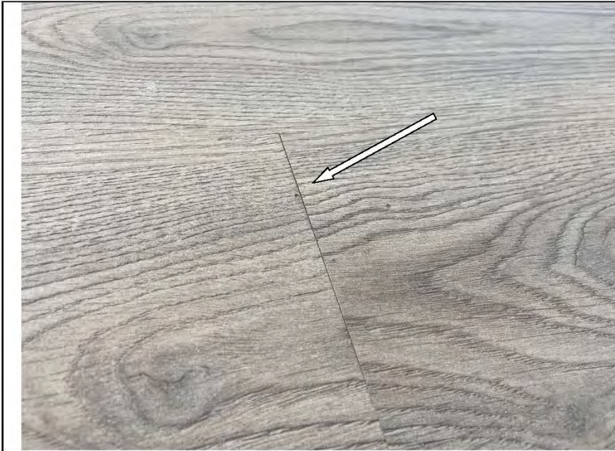
Фото №52. Поднятые кромки досок ламината в жилой комнате №2.
