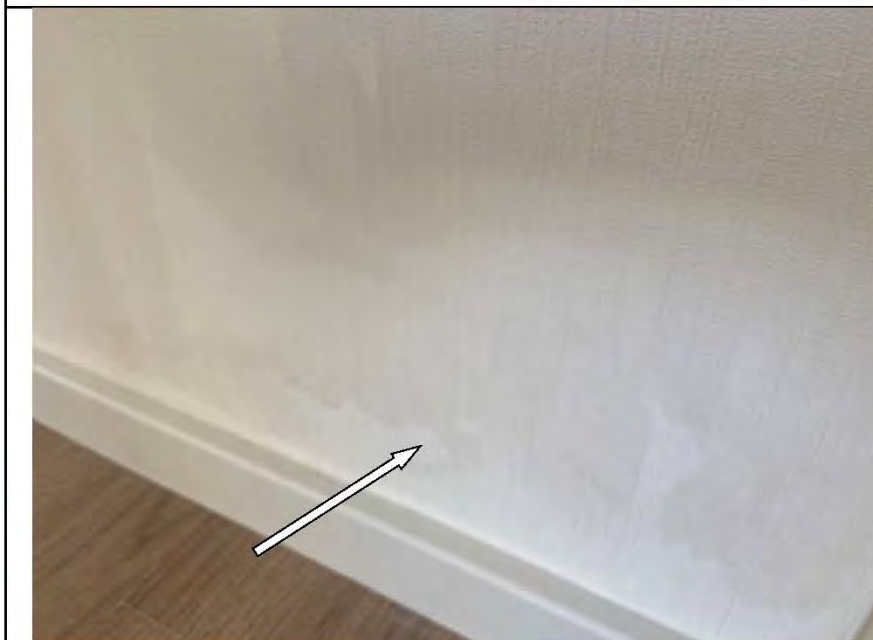
Фото №23. Следы залития на стенах, оклеенных обоями, в коридоре.
