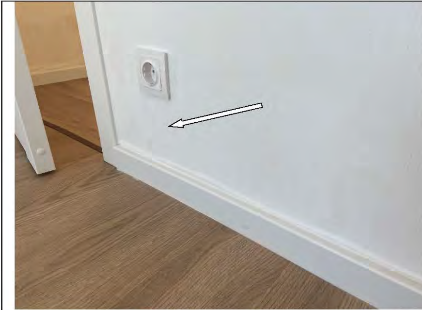
Фото №46. Следы залития на стенах, оклеенных обоями, в жилой комнате №2.
