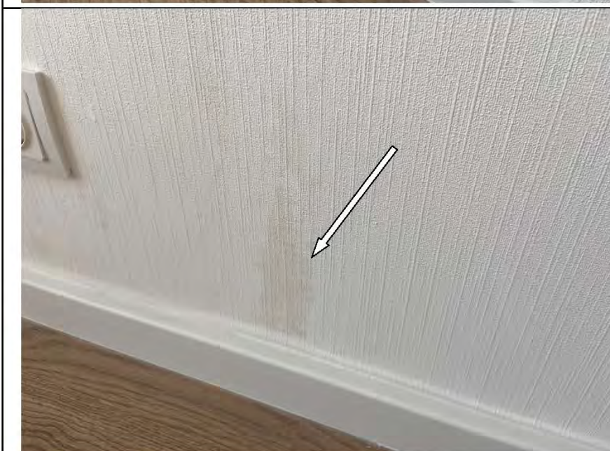
Фото №42. Следы залития на стенах, оклеенных обоями, в жилой комнате №2.
