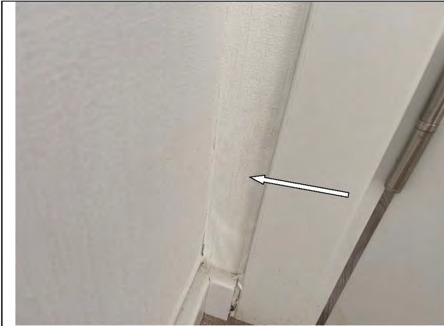
Фото №16. Следы заливания на стенах, оклеенных обоями, в жилой комнате №1.
