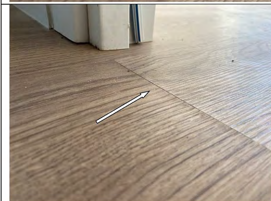
Фото №57. Поднятые кромки досок ламината в коридоре.
