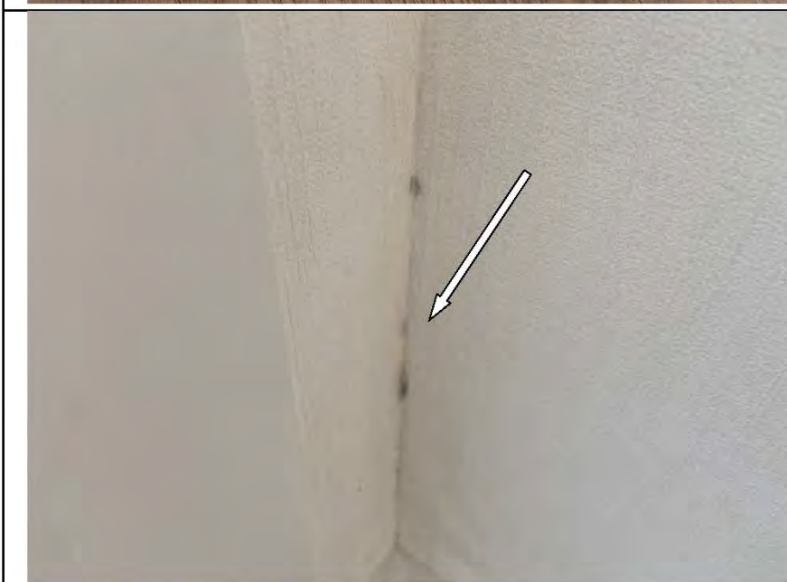
Фото №18. Следы заливания и плесени на стенах, оклеенных обоями, в коридоре.
