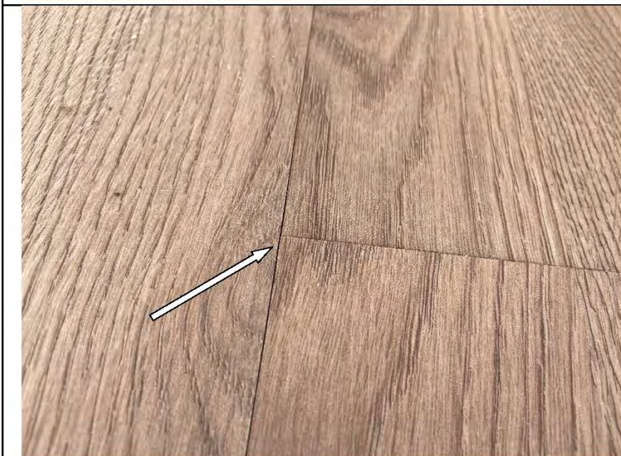
Фото №47. Поднятые кромки досок ламината в жилой комнате №1.
