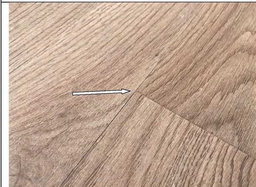
Фото №50. Поднятые кромки досок ламината в жилой комнате №1.
