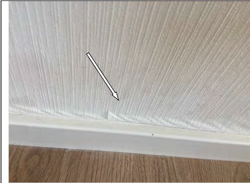
Фото №10. Следы залития на стенах, оклеенных обоями, в жилой комнате №1.
