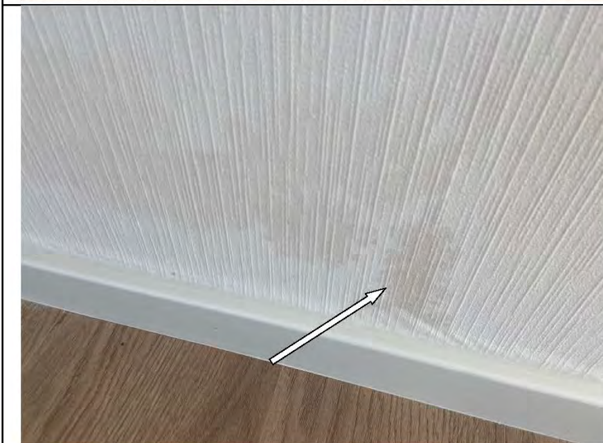
Фото №8. Следы залития на стенах, оклеенных обоями, в жилой комнате №1.
