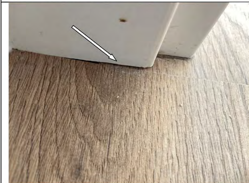
Фото №68. Следы залития на наличниках деревянного дверного блока в кухне.
