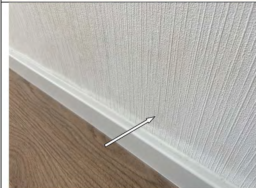
Фото №41. Следы залития на стенах, оклеенных обоями, в жилой комнате №2.
