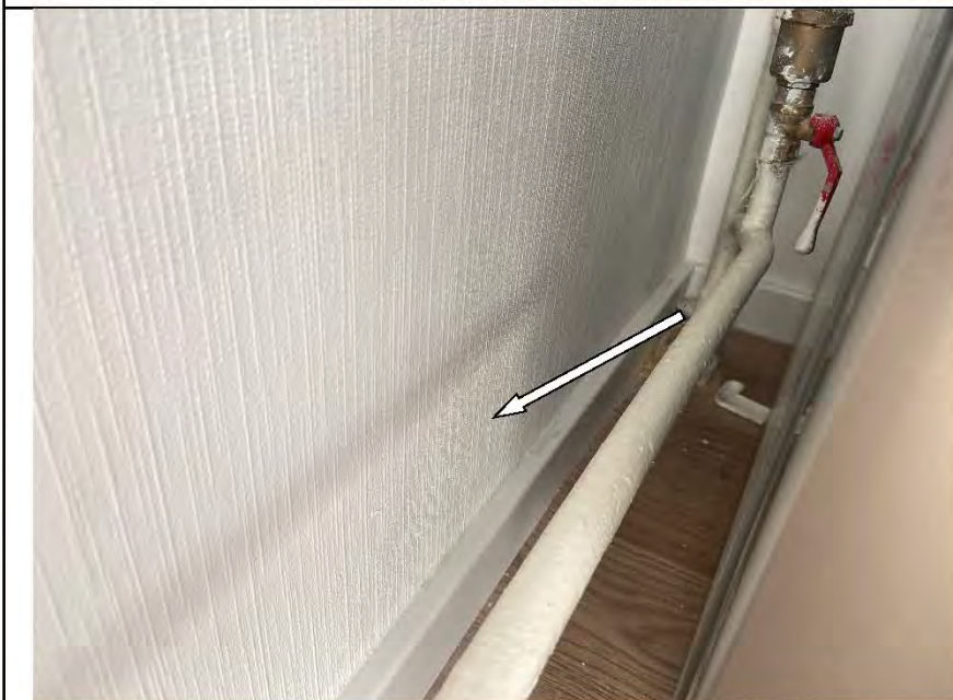
Фото №32. Следы залития на стенах, оклеенных обоями, в кухне.
