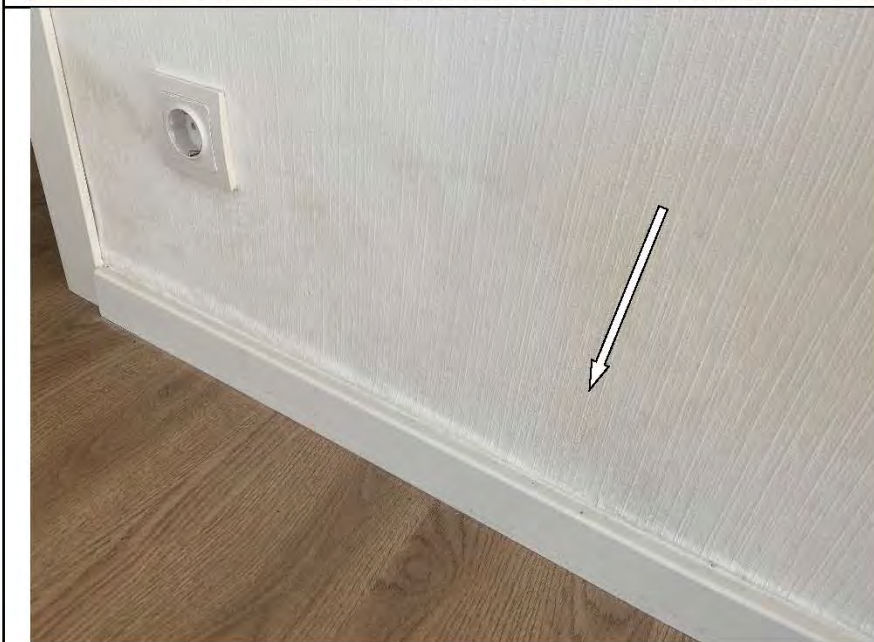
Фото №11. Следы залития на стенах, оклеенных обоями, в жилой комнате №1.
