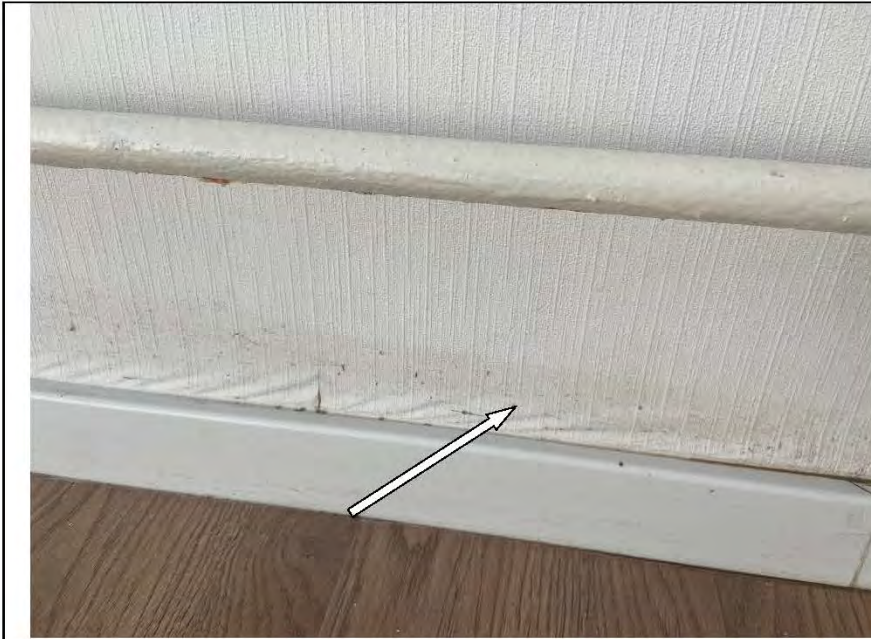
Фото №7. Следы залития на стенах, оклеенных обоями, в жилой комнате №1.
