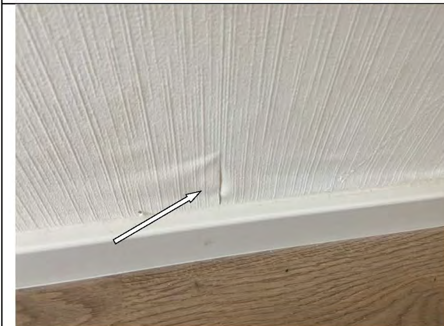
Фото №38. Следы заливания на стенах, оклеенных обоями, в жилой комнате №2.
