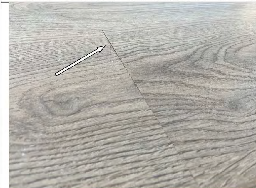
Фото №53. Поднятые кромки досок ламината в жилой комнате №2.
