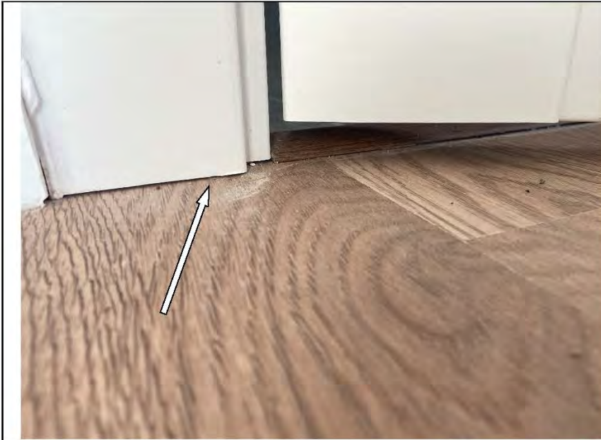
Фото №67. Следы залития на наличниках деревянного дверного блока в кухне.
