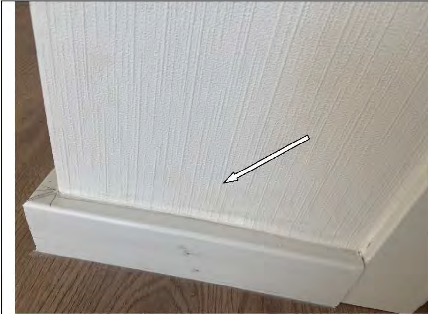
Фото №25. Следы залития на стенах, оклеенных обоями, в коридоре.
