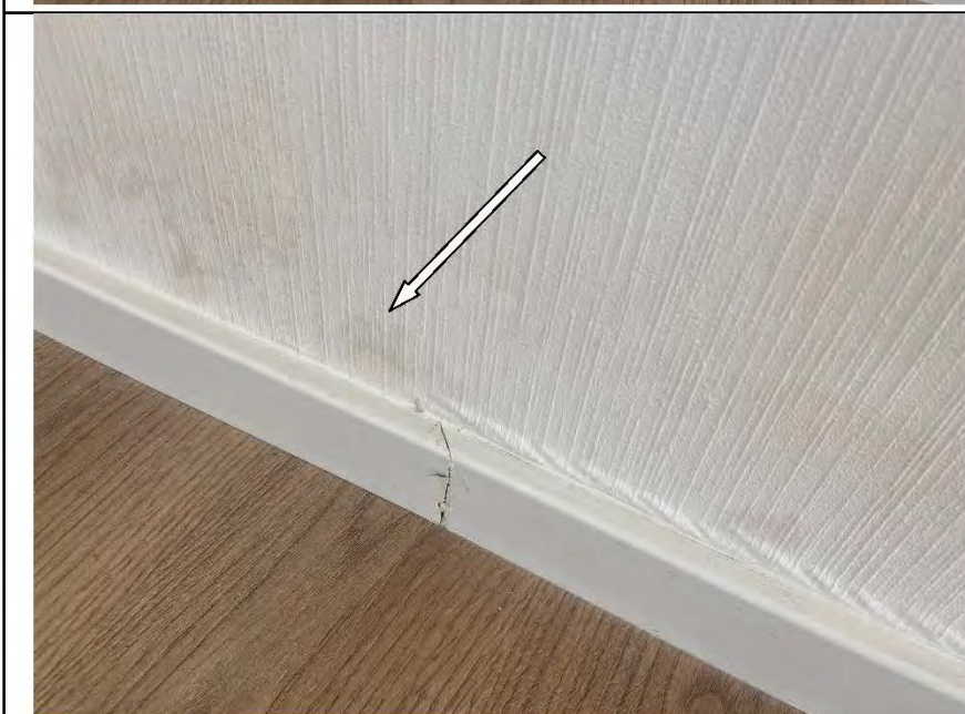
Фото №9. Следы залития на стенах, оклеенных обоями, в жилой комнате №1.
