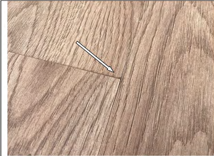
Фото №49. Поднятые кромки досок ламината в жилой комнате №1.
