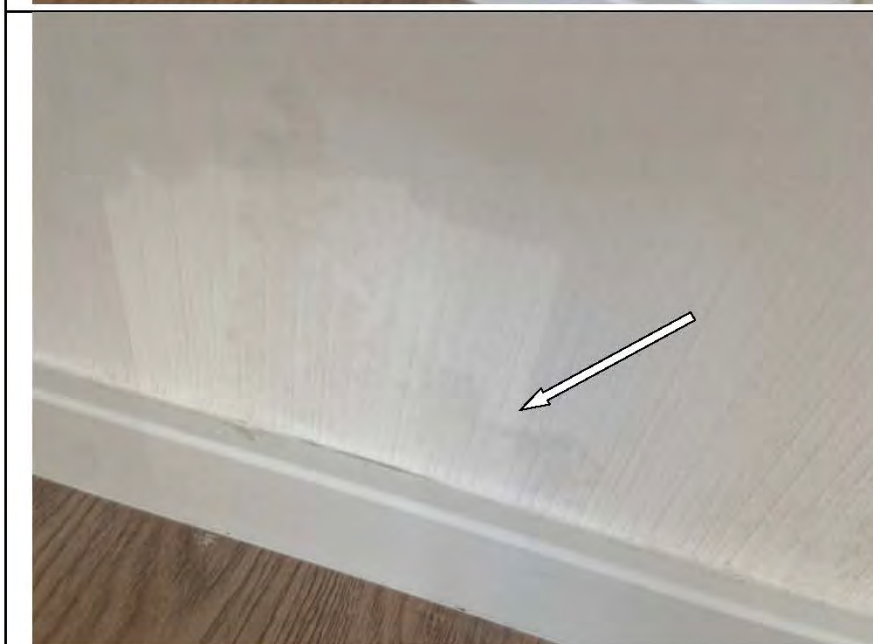
Фото №24. Следы залития на стенах, оклеенных обоями, в коридоре.
