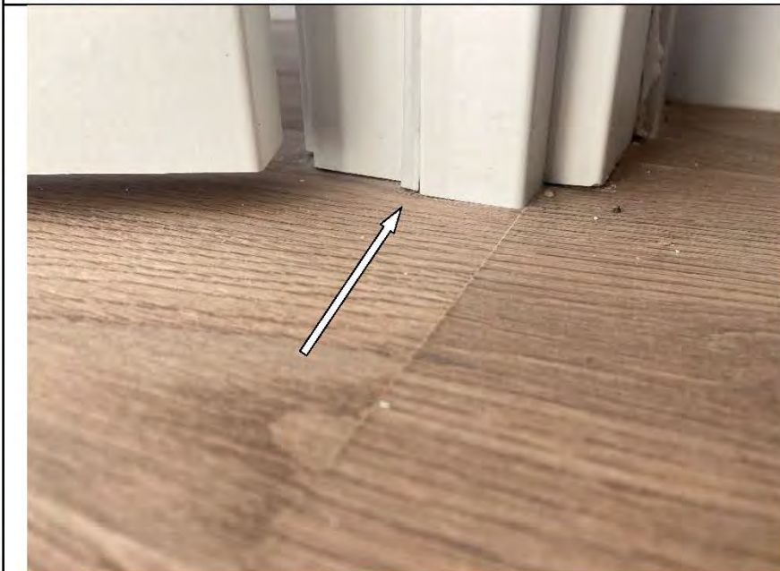
Фото №65. Следы залития на коробке деревянного дверного блока в жилой комнате №1.
