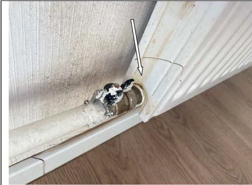
Фото №70. Следы протечки в местах соединений отопительного прибора в жилой комнате №1.
