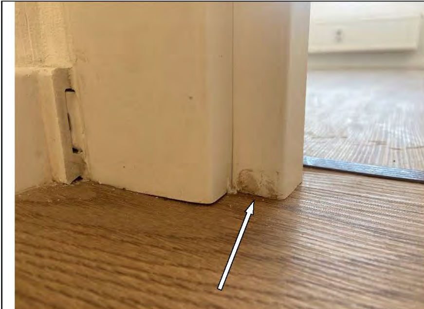
Фото №64. Следы залития на коробке деревянного дверного блока в жилой комнате №1.
