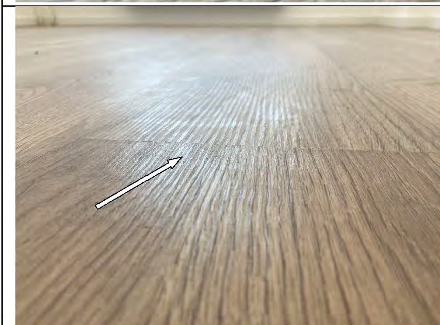
Фото №54. Поднятые кромки досок ламината в жилой комнате №2.
