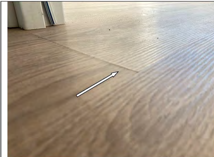
Фото №55. Поднятые кромки досок ламината в жилой комнате №2.
