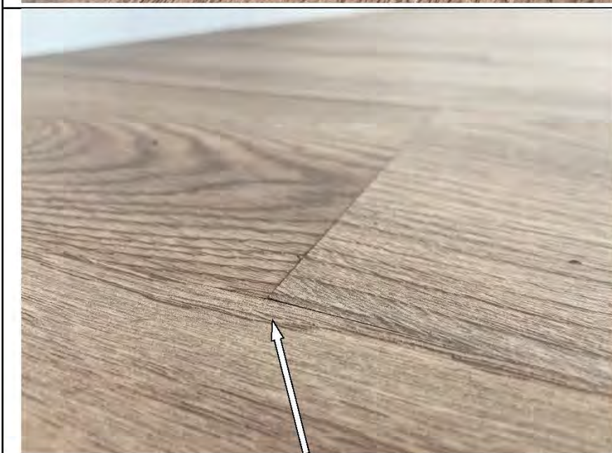
Фото №51. Поднятые кромки досок ламината в жилой комнате №1.
