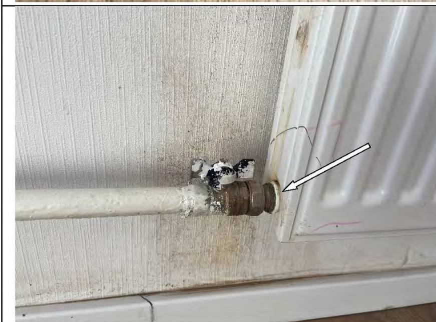
Фото №69. Следы протечки в местах соединений отопительного прибора в жилой комнате №1.
