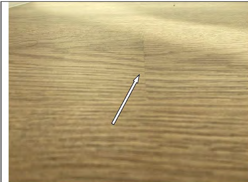
Фото №58. Поднятые кромки досок ламината в коридоре.
