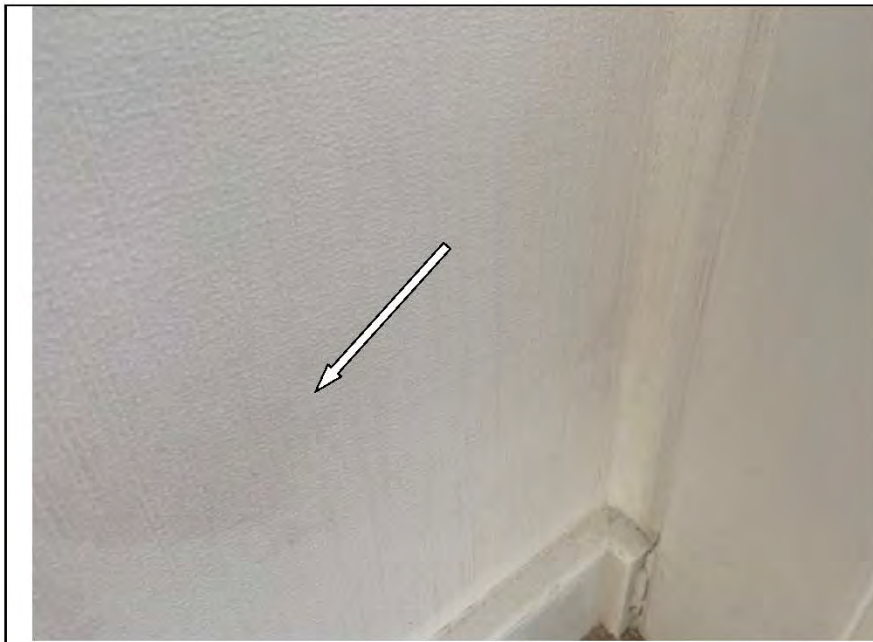
Фото №22. Следы залития на стенах, оклеенных обоями, в коридоре.
