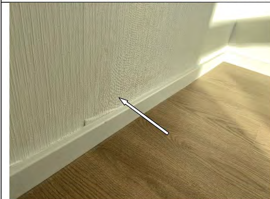
Фото №29. Следы залития на стенах, оклеенных обоями, в кухне.
