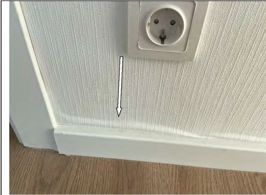
Фото №28. Следы залития на стенах, оклеенных обоями, в кухне.
