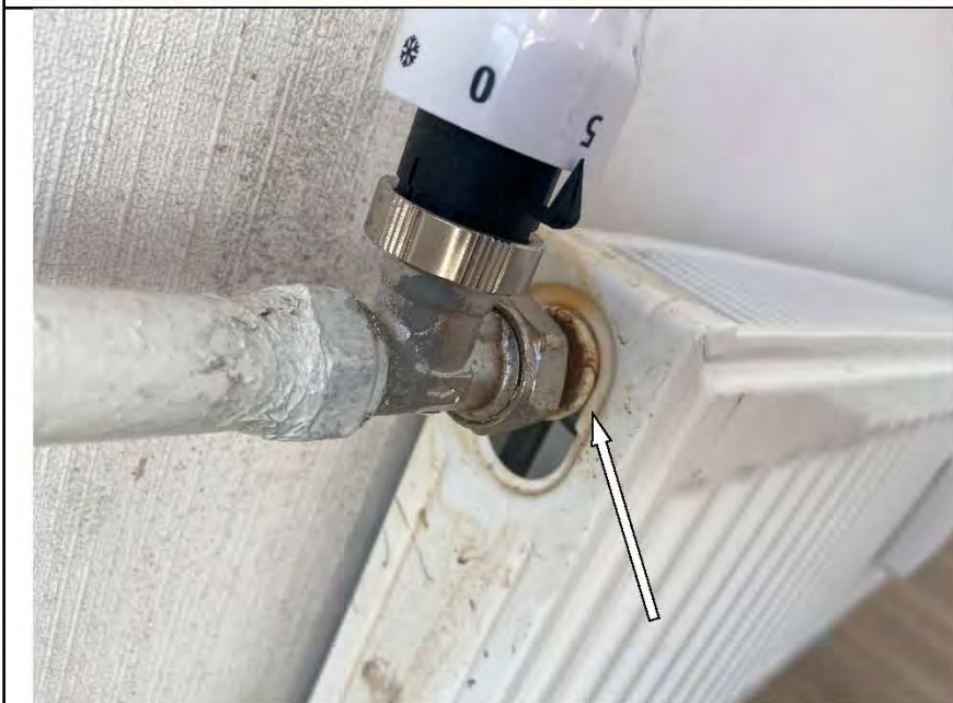
Фото №71. Следы протечки в местах соединений отопительного прибора в жилой комнате №1.
