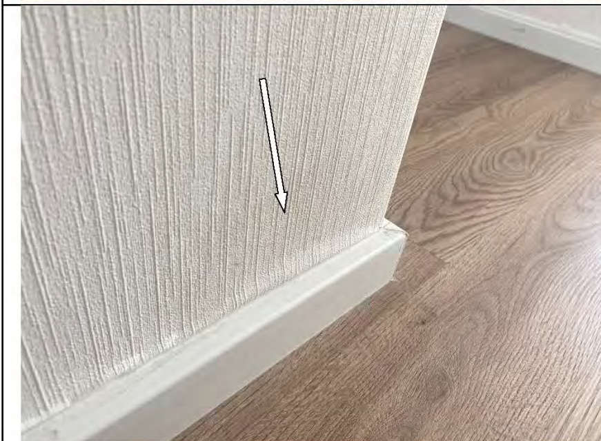
Фото №26. Следы залития на стенах, оклеенных обоями, в коридоре.
