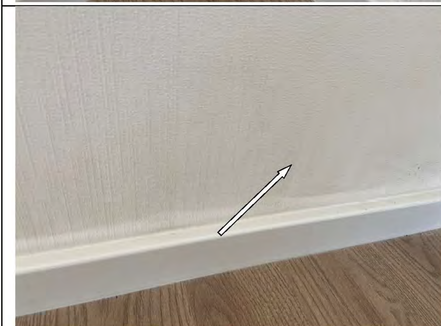
Фото №45. Следы залития на стенах, оклеенных обоями, в жилой комнате №2.
