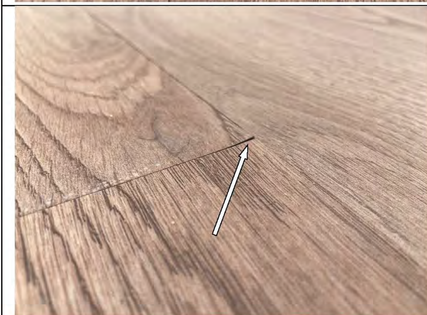
Фото №48. Поднятые кромки досок ламината в жилой комнате №1.
