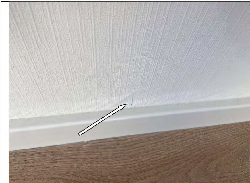
Фото №14. Следы залития на стенах, оклеенных обоями, в жилой комнате №1.
