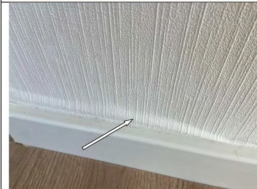
Фото №35. Следы залития на стенах, оклеенных обоями, в кухне.
