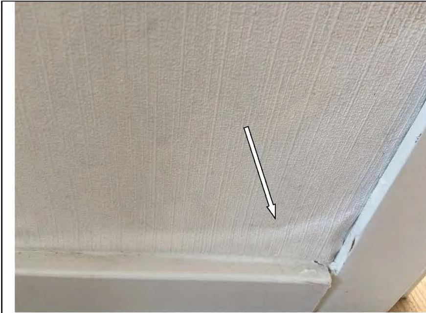
Фото №19. Следы залития на стенах, оклеенных обоями, в коридоре.
