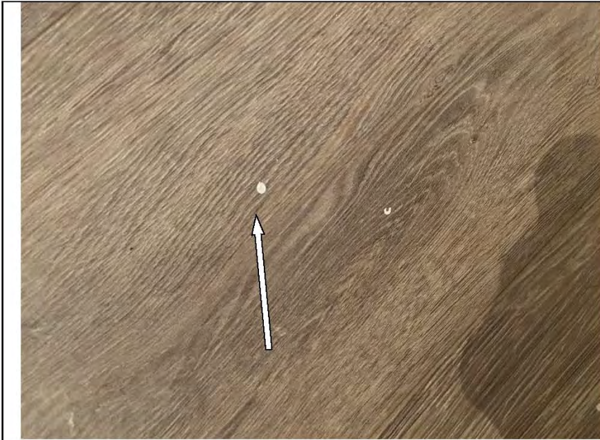
Фото №28. Загрязнения на ламинате в спальне в квартире.
