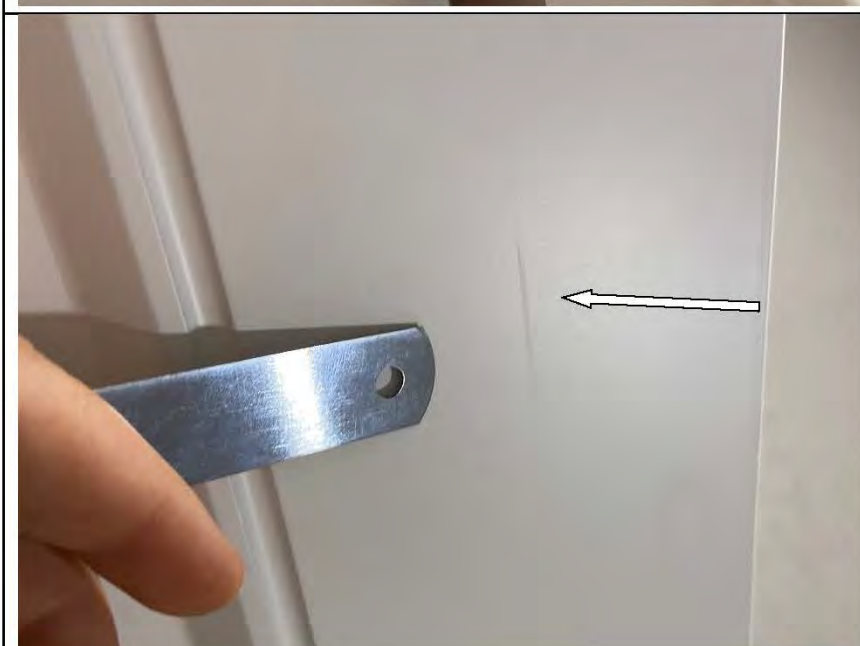
Фото №63. Царапина на полотне деревянного дверного блока в ванной комнате в квартире.
