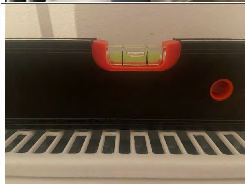
Фото №93. Неровно смонтирован отопительный прибор в спальне в квартире.
