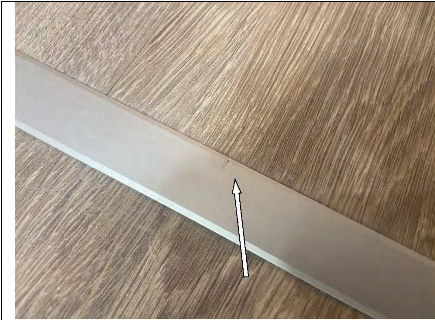
Фото №43. Скол на напольном металлическом порошке в спальне в квартире.
