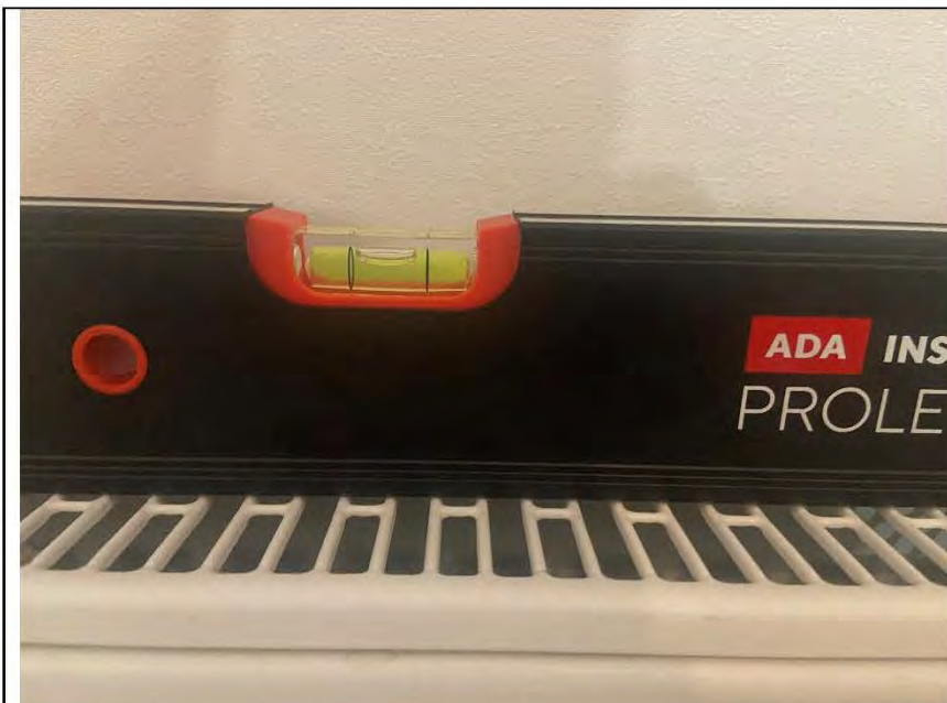
Фото №94. Неровно смонтирован отопительный прибор в кабинете в квартире.
