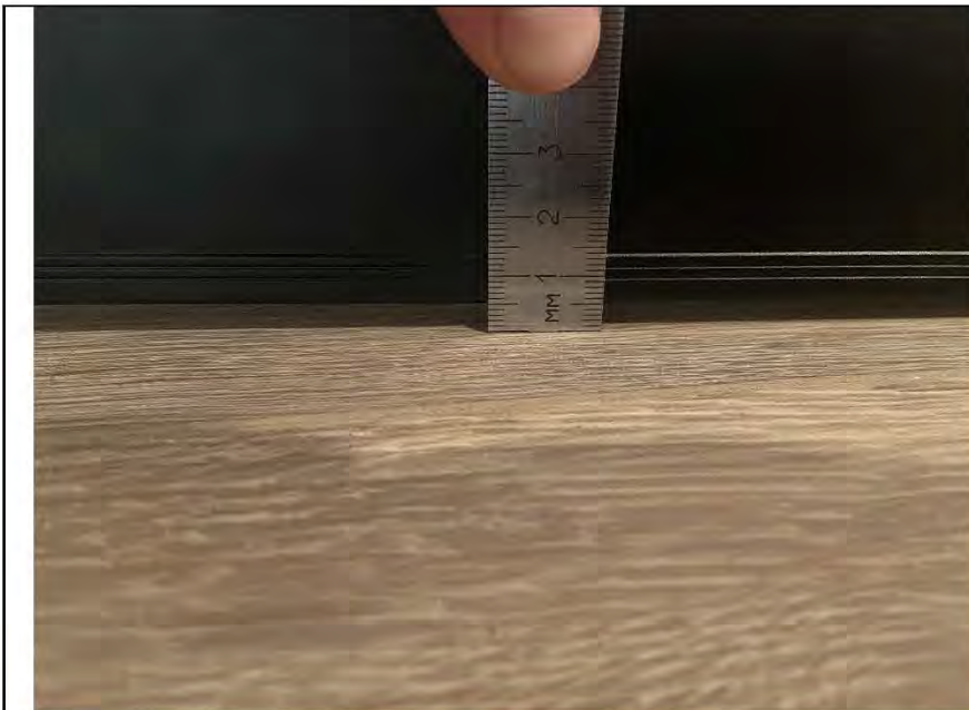
Фото №25. Отклонения поверхности напольного покрытия из ламината в кухне.
