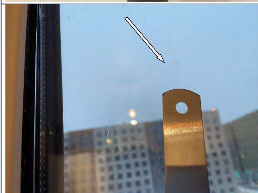
Фото №50. Царапина на стеклопакете оконного блока ПВХ в кабинете в квартире.
