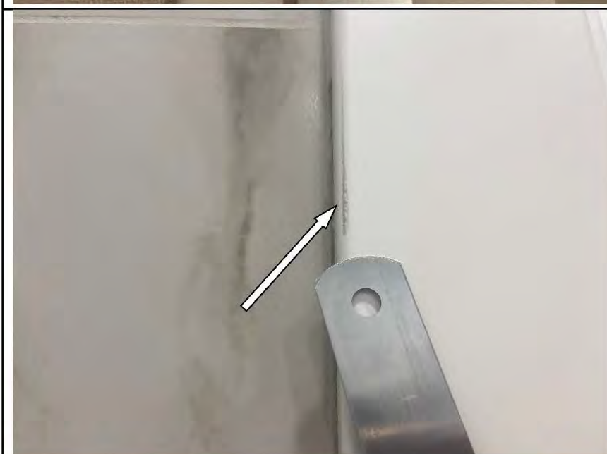
Фото №77. Загрязнения на наличнике деревянного дверного блока в санузле в квартире.
