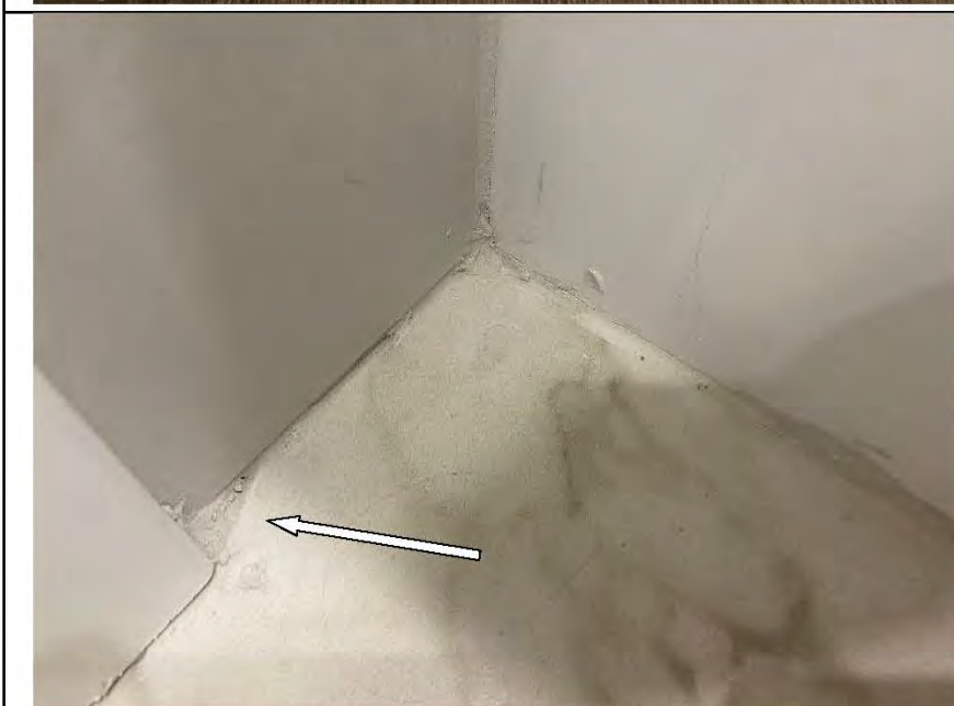
Фото №35. Загрязнения на напольной керамической плитке в ванной комнате.
