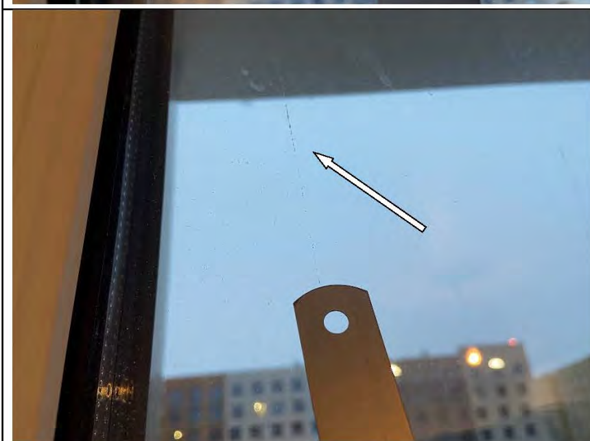
Фото №51. Царапина на стеклопакете оконного блока ПВХ в кабинете в квартире.
