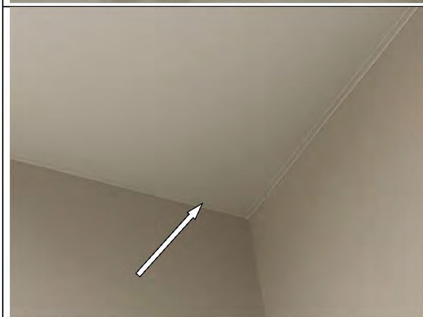
Фото №87. Загрязнения на полотне натяжного потолка в кухне в квартире.
