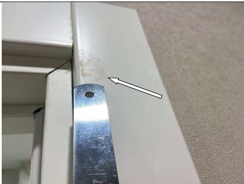
Фото №75. Загрязнения на наличнике деревянного дверного блока в ванной комнате в квартире.
