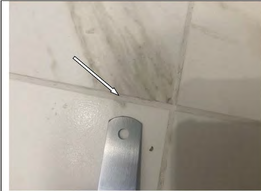
Фото №40. Скол на напольной керамической плитке в санузле в квартире.
