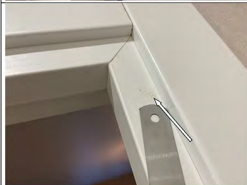
Фото №69. Загрязнения на коробке деревянного дверного блока в кабинете в квартире.
