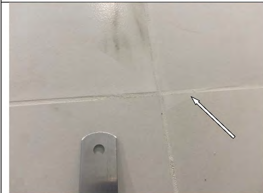
Фото №17. Неровный шов настенной керамической плитки в санузле.
