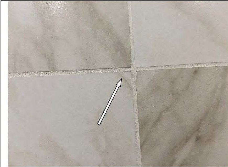
Фото №16. Неровный шов настенной керамической плитки в ванной комнате.
