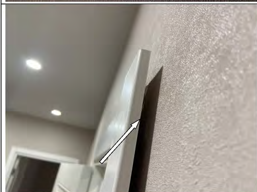
Фото №80. Неплотное прилегание наличника деревянного дверного блока в ванной комнате в квартире.
