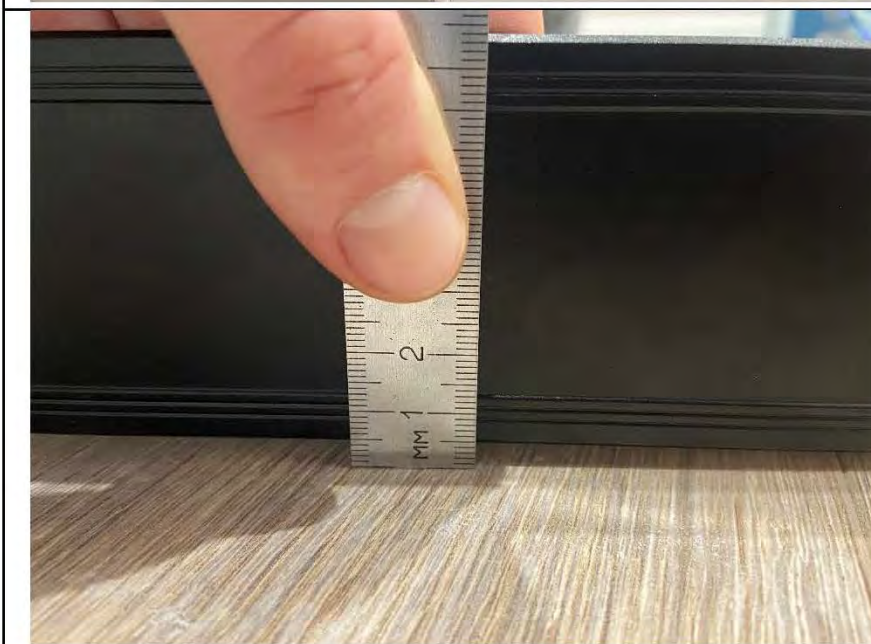
Фото №21. Отклонения поверхности напольного покрытия из ламината в прихожей.
