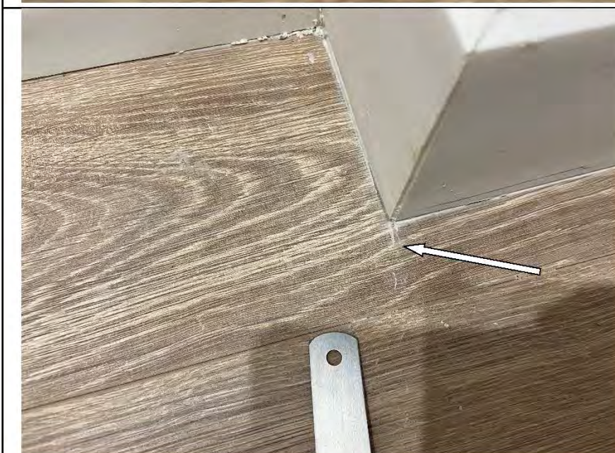
Фото №26. Загрязнения на ламинате в прихожей в квартире.
