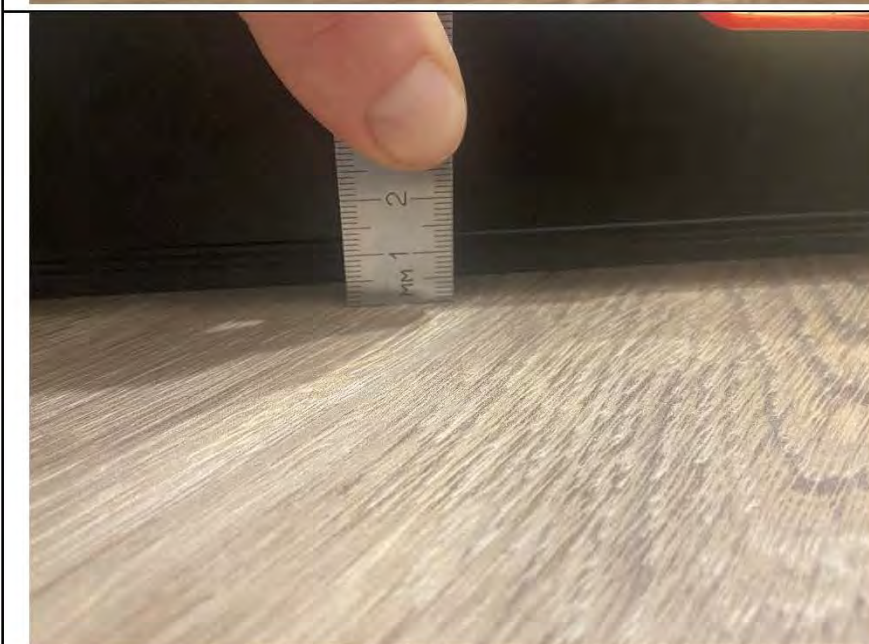
Фото №24. Отклонения поверхности напольного покрытия из ламината в коридоре.
