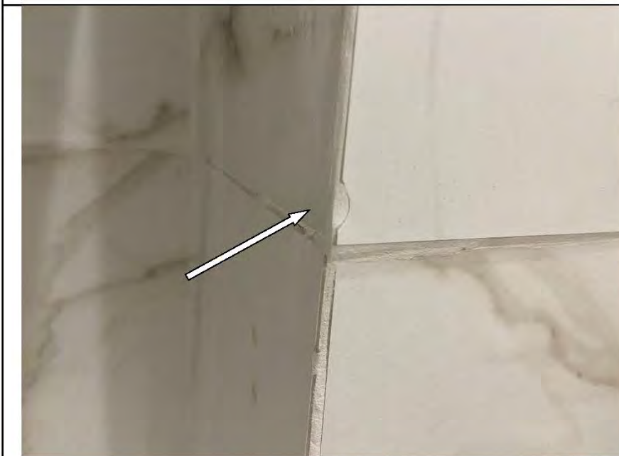
Фото №20. Скол на настенной керамической плитке в ванной комнате в квартире.
