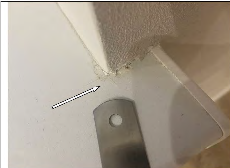
Фото №46. Загрязнения на подоконной доске в кухне в квартире.
