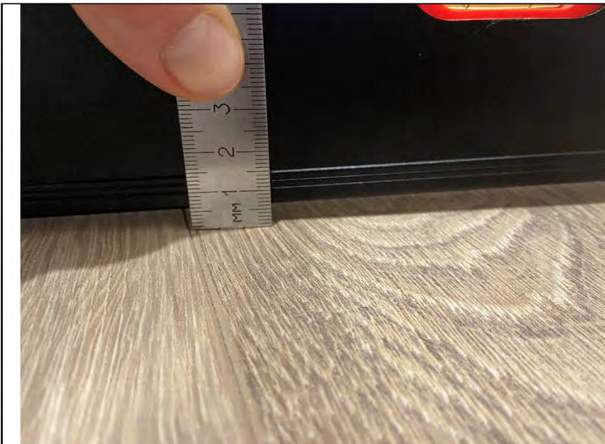
Фото №22. Отклонения поверхности напольного покрытия из ламината в кабинете.
