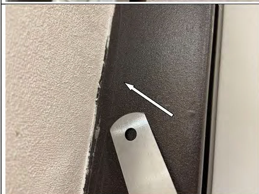
Фото №81. Царапина на коробке комбинированного дверного блока.
