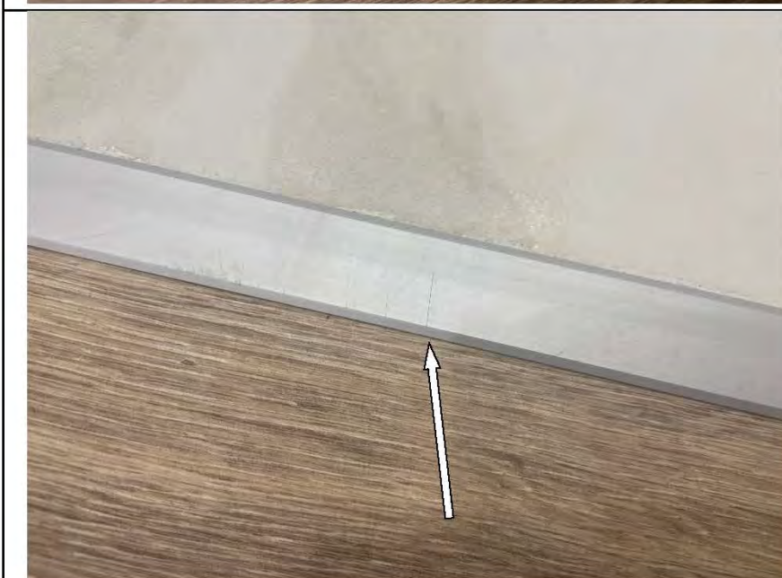
Фото №42. Царапина на напольном металлическом порожке в ванной комнате в квартире.
