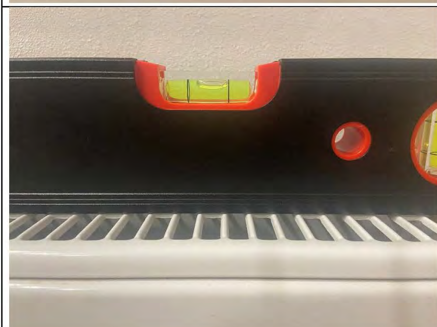
Фото №95. Неровно смонтирован отопительный прибор в кухне в квартире.
