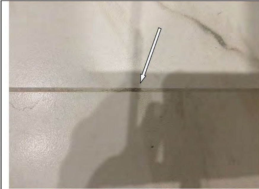
Фото №37. Неровный шов напольной керамической плитки в ванной комнате.
