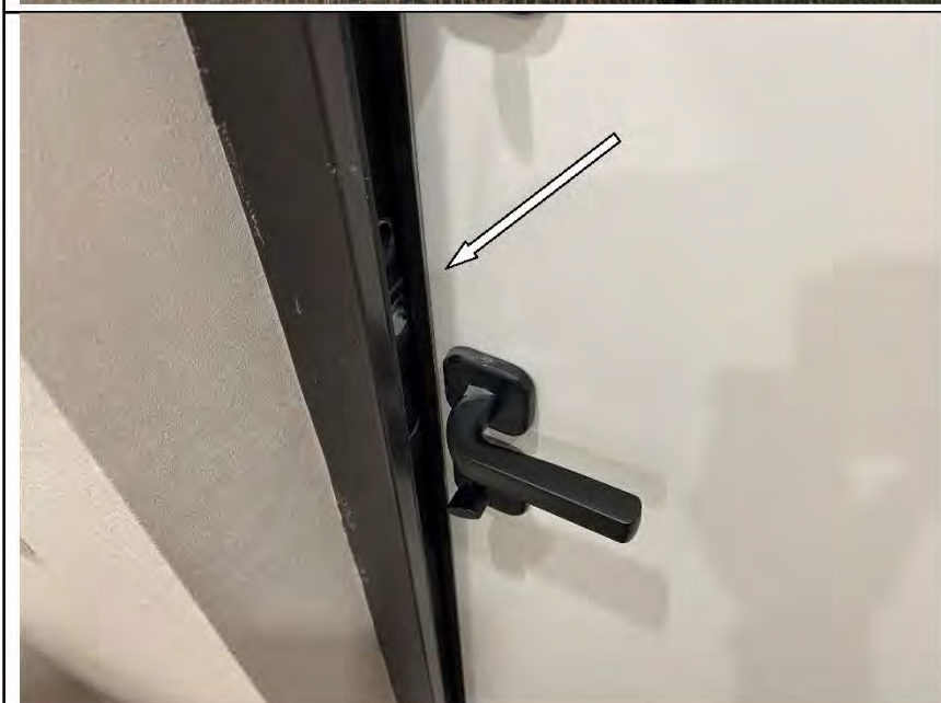
Фото №68. Не закрывается/открывается входная дверь.
