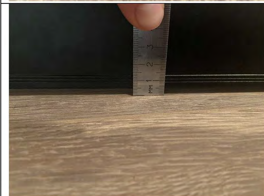
Фото №23. Отклонения поверхности напольного покрытия из ламината в спальне.
