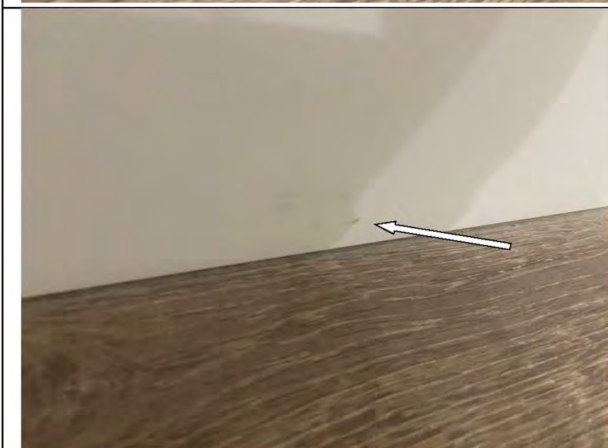
Фото №32. Загрязнения на напольном плинтусе в спальне в квартире.
