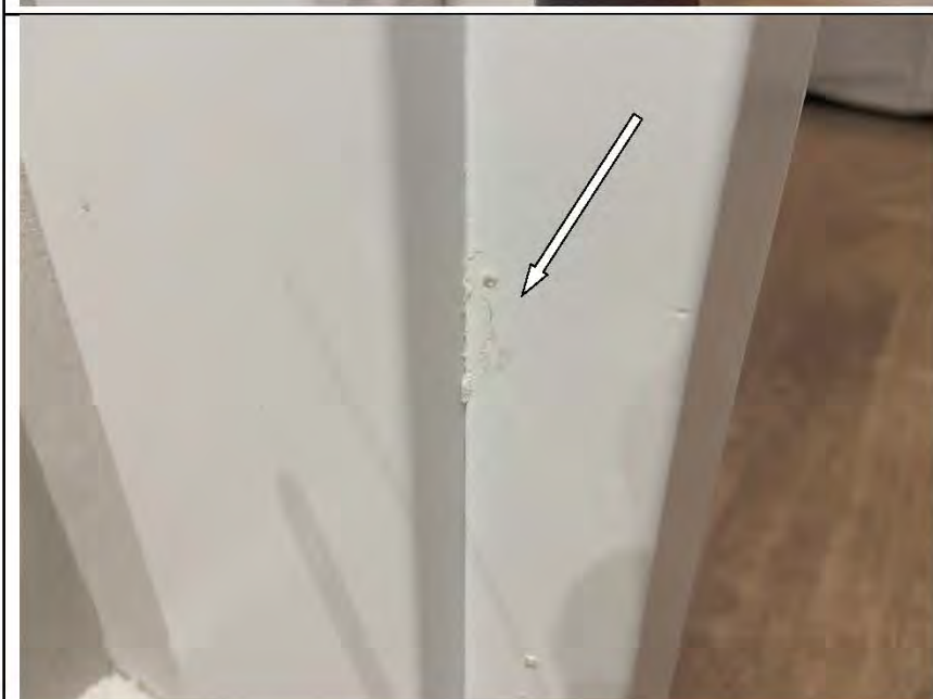
Фото №71. Загрязнения на коробке деревянного дверного блока в спальне в квартире.
