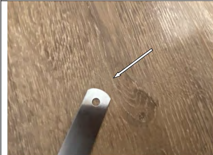
Фото №29. Царапина на ламинате в кухне в квартире.
