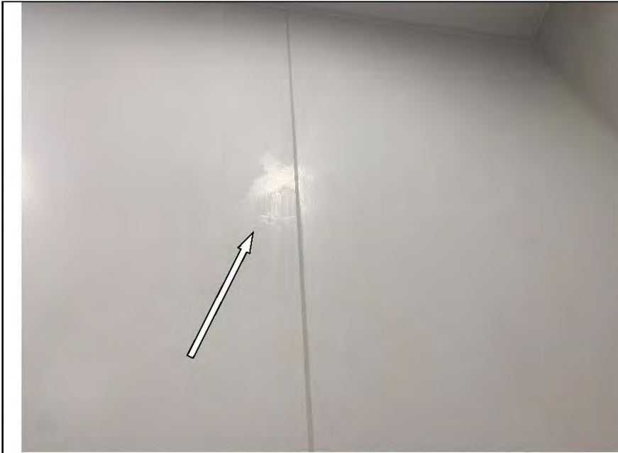
Фото №19. Загрязнения на настенной керамической плитке в санузле.
