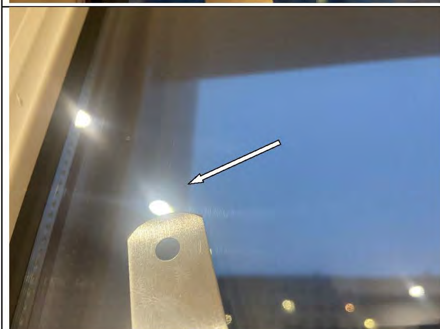
Фото №53. Царапина на стеклопакете оконного блока ПВХ в кухне в квартире.
