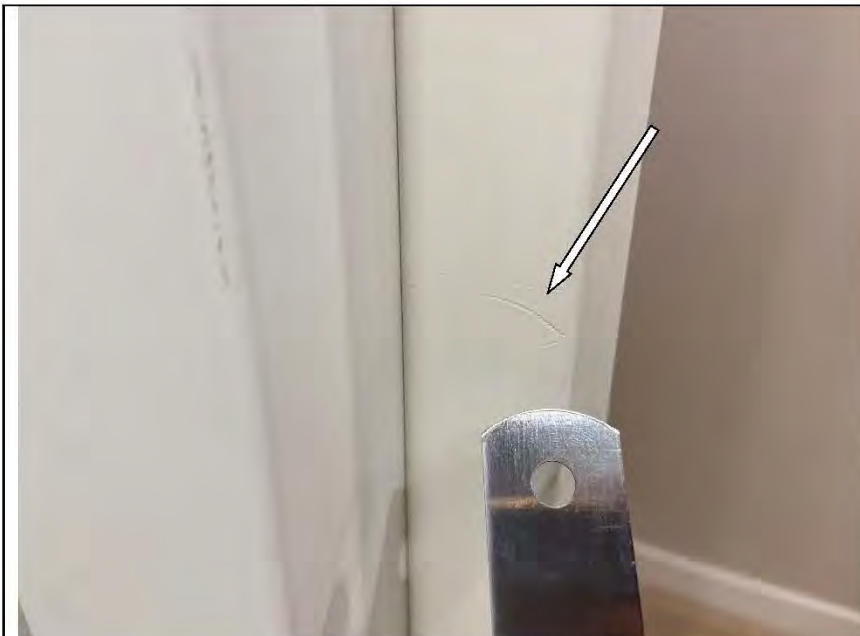
Фото №70. Царапина на коробке деревянного дверного блока в ванной комнате в квартире.
