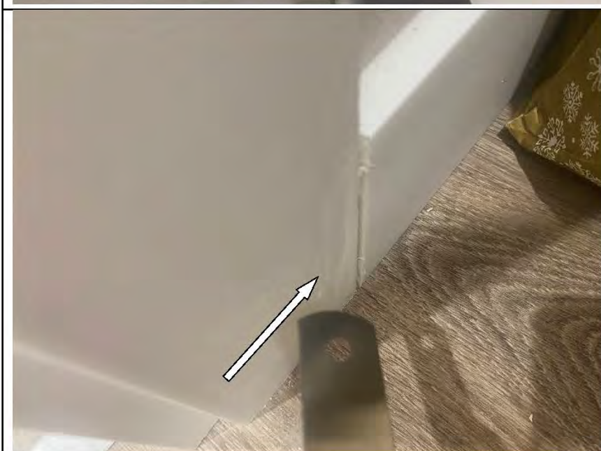
Фото №78. Загрязнения на наличнике деревянного дверного блока в коридоре в квартире.
