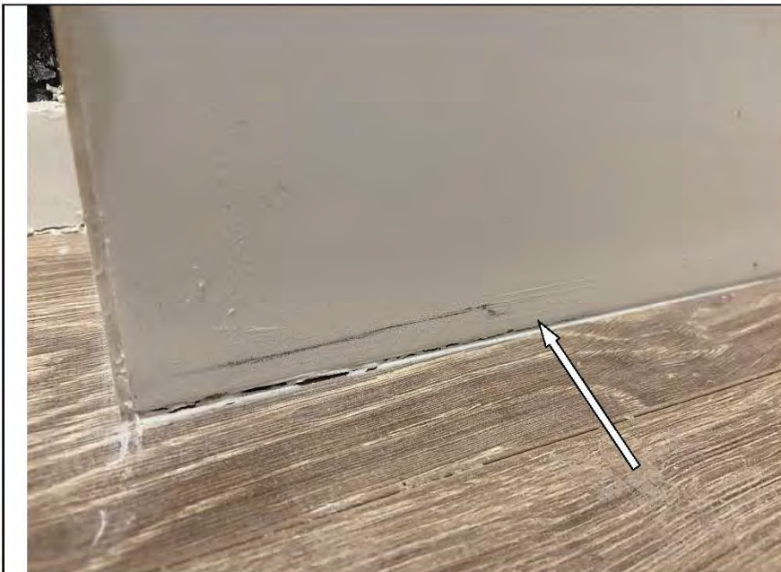
Фото №31. Загрязнения на напольном плинтусе в прихожей в квартире.
