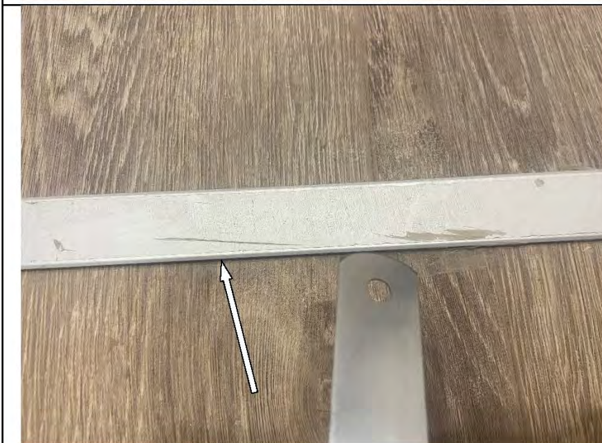
Фото №44. Царапина на напольном металлическом порошке в прихожей в квартире.
