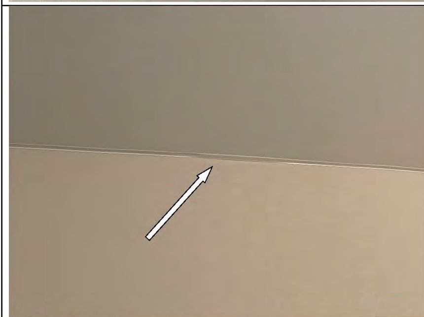
Фото №89. Дефект гибкой вставки полотна натяжного потолка в спальне в квартире.
