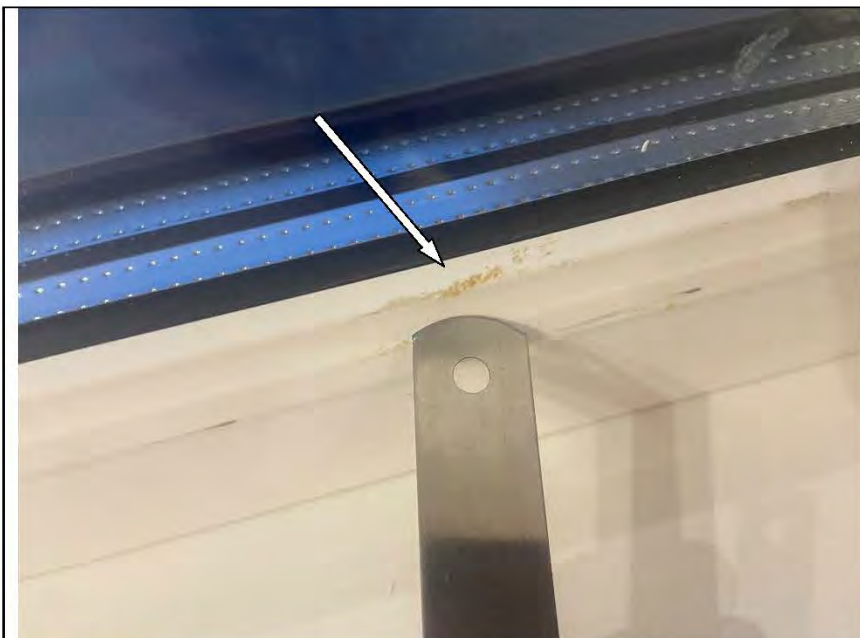
Фото №49. Загрязнения на профиле оконного блока ПВХ в кухне в квартире.
