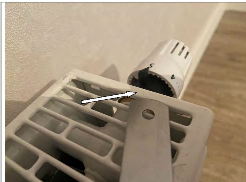
Фото №91. Царапина на отопительном приборе в спальне в квартире.
