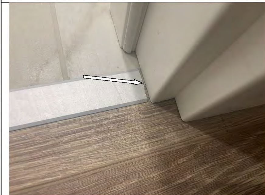
Фото №41. Короткий напольный металлический порожек в санузле в квартире.
