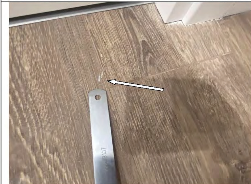
Фото №30. Загрязнения на ламинате в коридоре в квартире.
