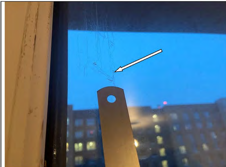
Фото №52. Царапина на стеклопакете оконного блока ПВХ в спальне в квартире.
