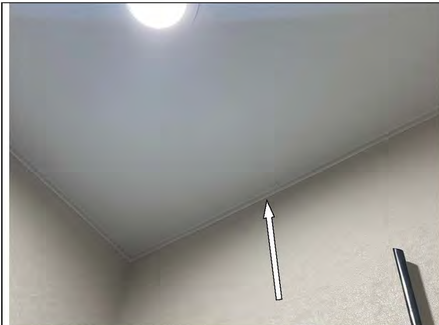
Фото №82. Загрязнения на полотне натяжного потолка в прихожей в квартире.
