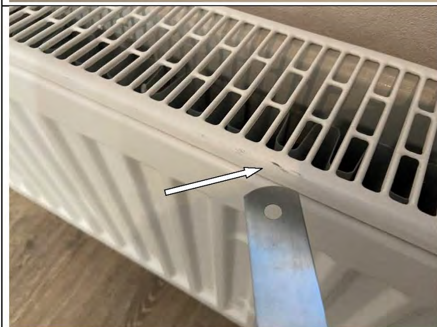
Фото №90. Царапина на отопительном приборе в кабинете в квартире.
