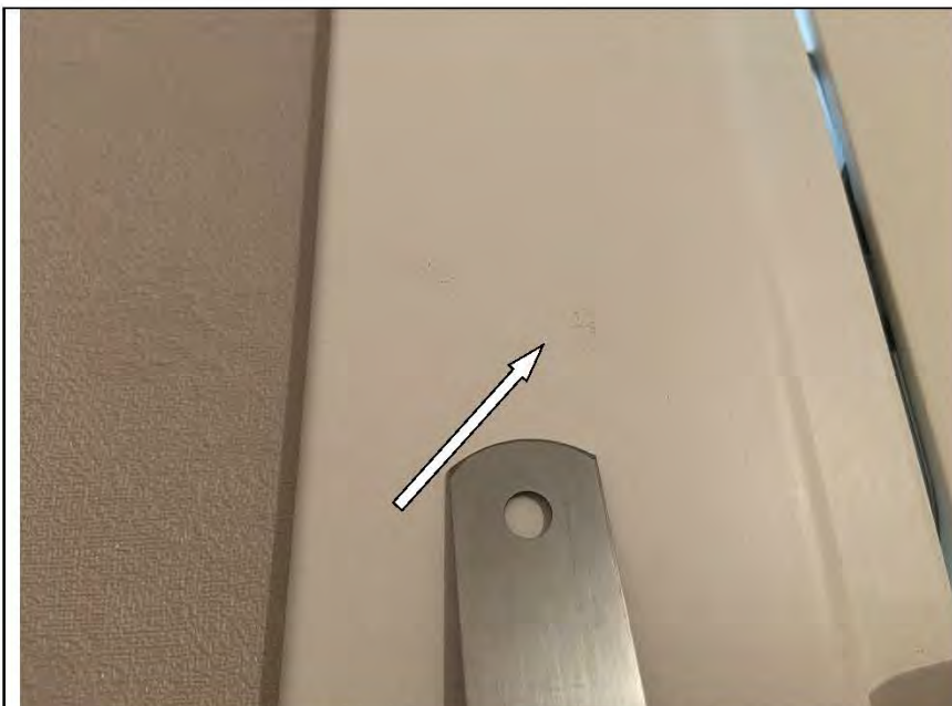
Фото №76. Загрязнения на наличнике деревянного дверного блока в спальне в квартире.
