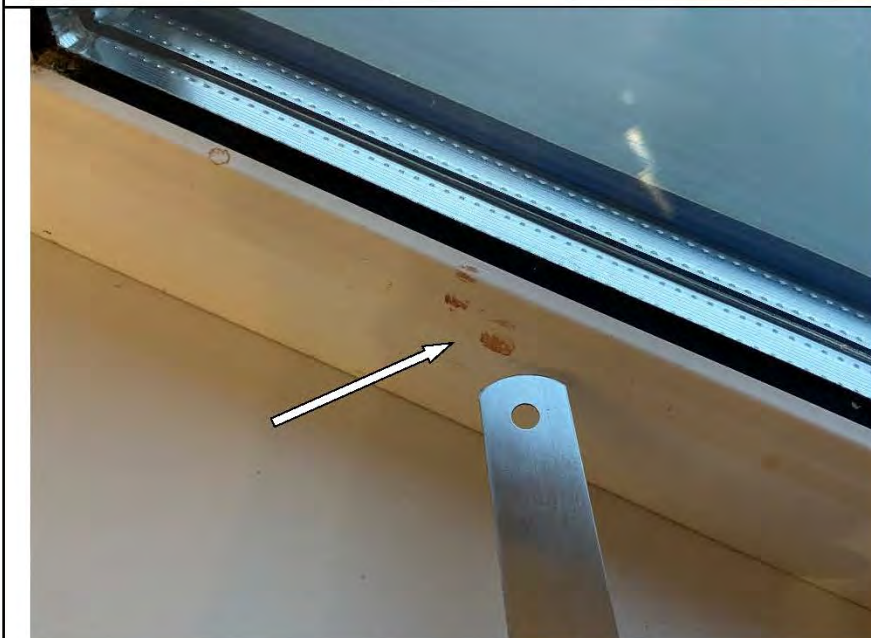
Фото №47. Загрязнения на профиле оконного блока ПВХ в кабинете в квартире.
