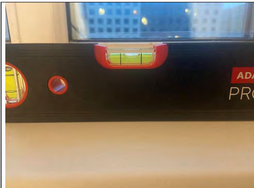
Фото №58. Неровно смонтирован подоконник в кабинете в квартире.
