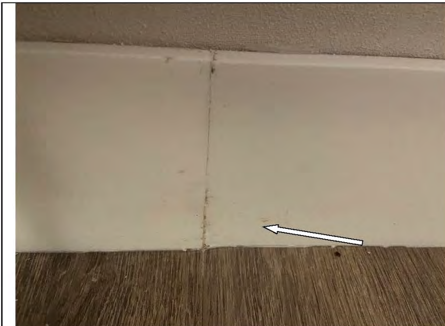
Фото №34. Загрязнения на напольном плинтусе в кабинете в квартире.
