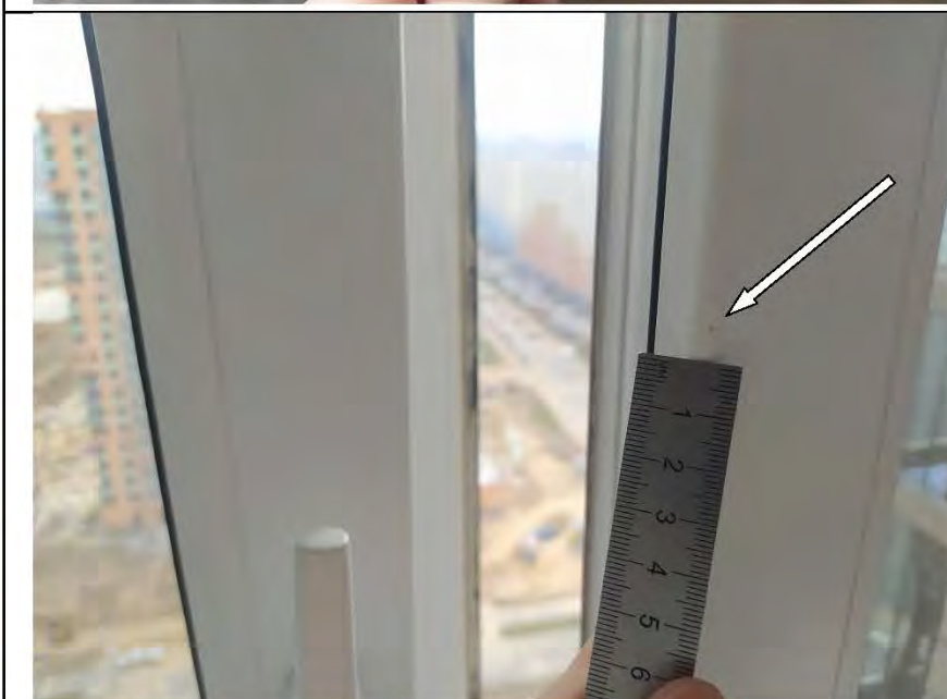
Фото №23. Профиль ПВХ оконного блока в кухне имеет дефекты (окалина).
