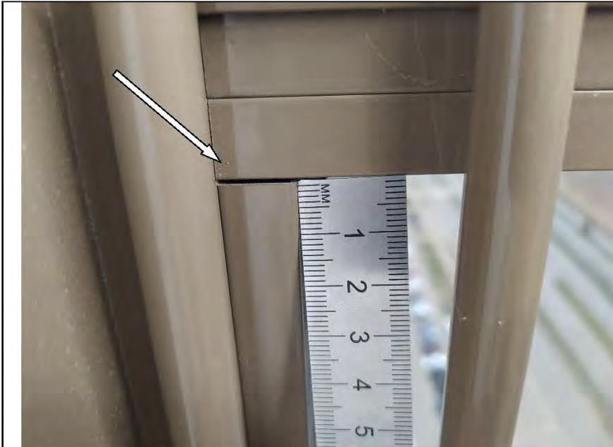
Фото №28. Дефект на металлическом профиле (зазор) оконного блока на балконе.
