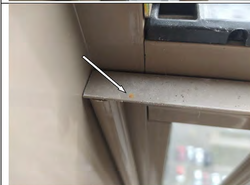
Фото №29. Дефект металлического профиля ограждения балкона (коррозия).
