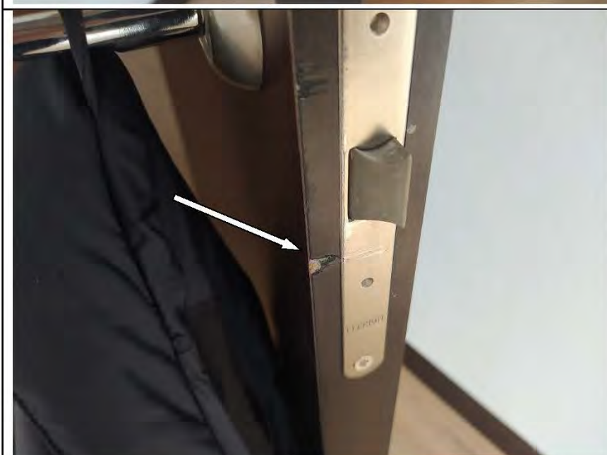
Фото №47. Дефекты (притертость) на лицевой поверхности полотна деревянного дверного блока в гостиной.
