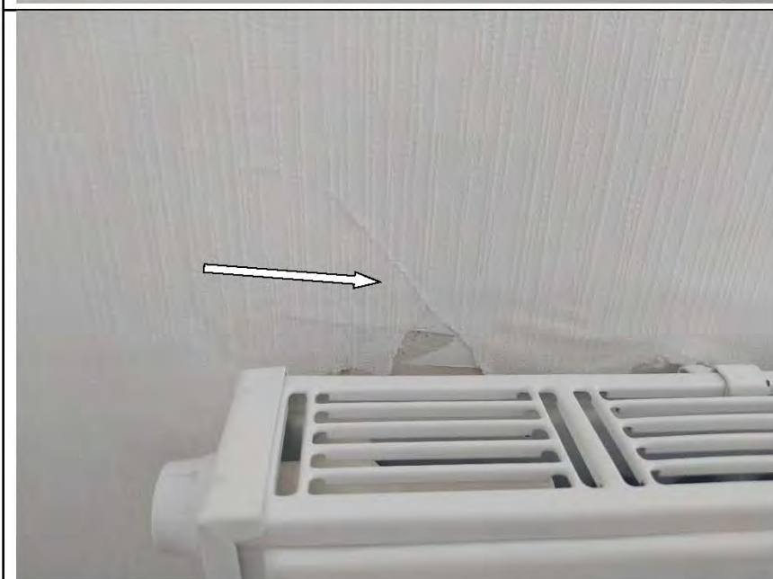
Фото №53. Замятия, разрывы обоев в спальне.
