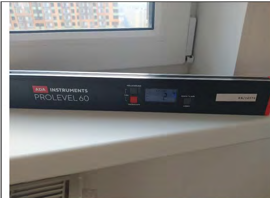
Фото №31. Отклонение по горизонтали подоконной доски в гостиной.
