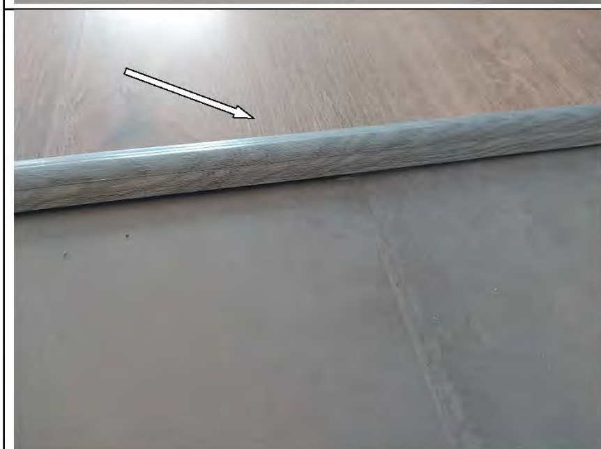
Фото №59. Вздутие ламината в кухне.
