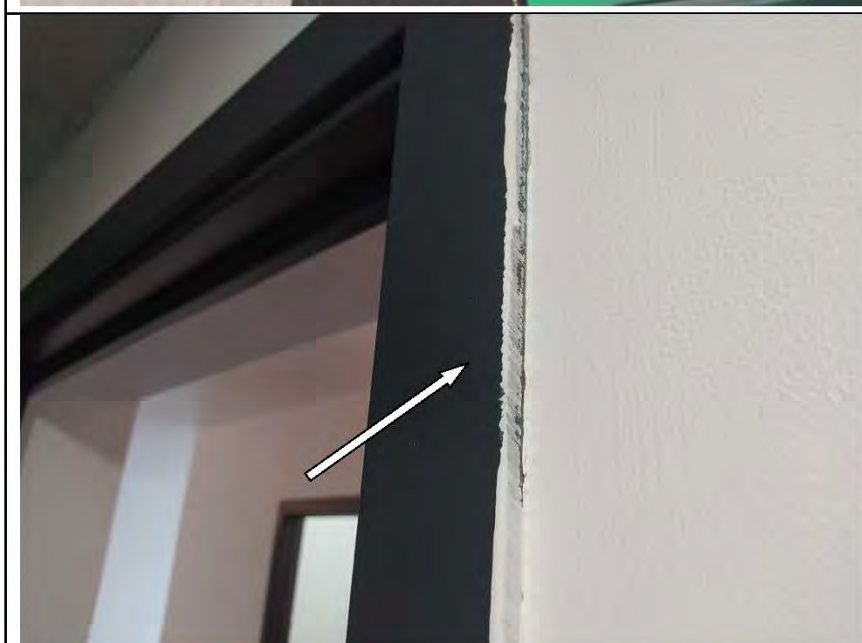
Фото №66. Коробка входной металлической двери имеет дефекты (загрязнение малярными составами).
