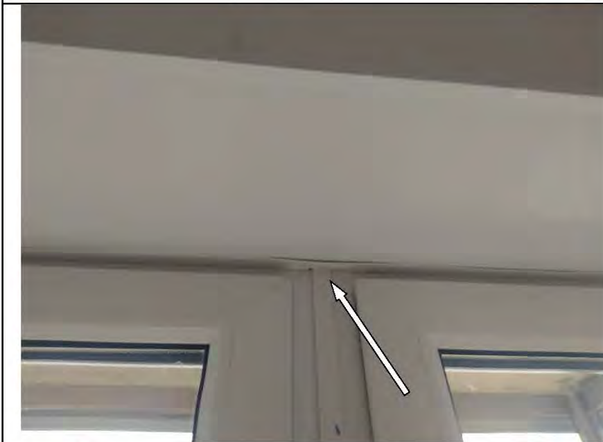
Фото №20. Трещина (щель) в месте примыкания накладных внутренних откосов оконно-дверного блока ПВХ в спальне.
