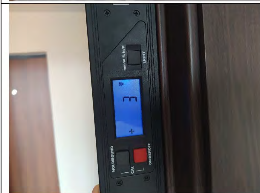
Фото №39. Отклонение коробки дверного блока в спальне.
