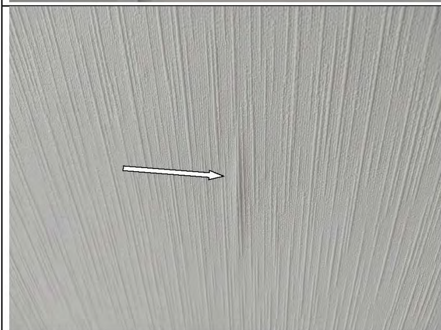
Фото №54. Отслоение обоев в кухне.
