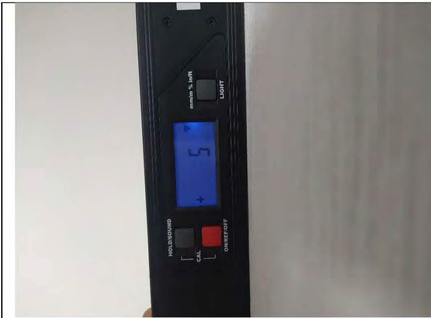
Фото №7. Измерения уровня стен в спальне.
