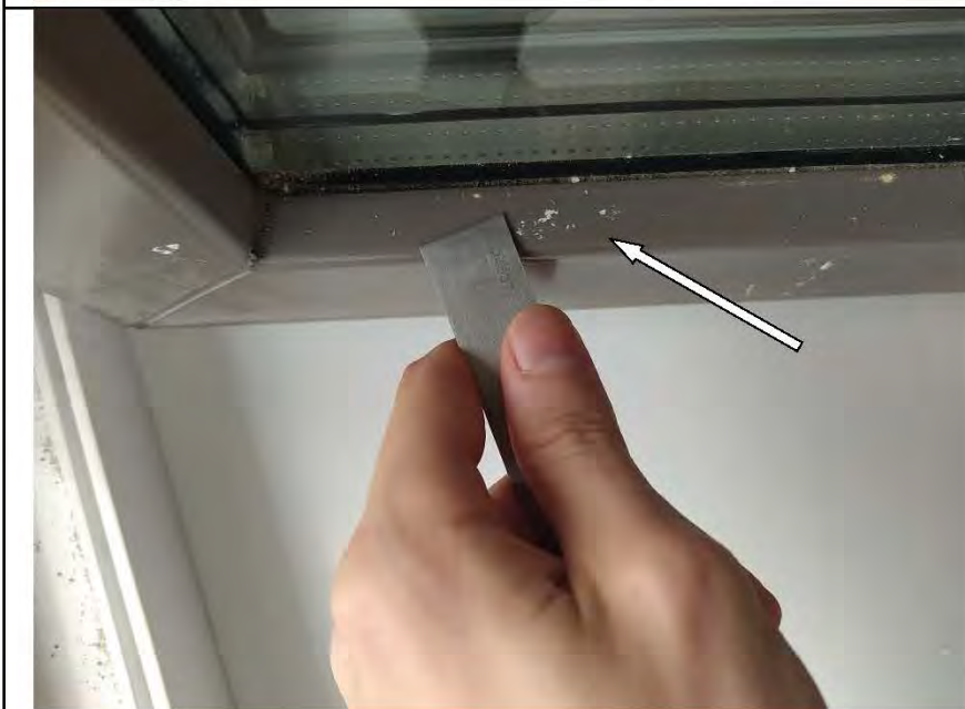
Фото №26. Профиль ПВХ оконно-дверного блока в спальне имеет дефекты (сколы).
