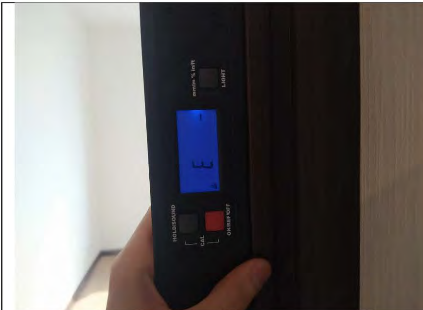
Фото №40. Отклонение коробки дверного блока в гостиной.
