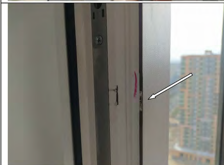
Фото №24. Профиль ПВХ оконного блока в гостиной имеет дефекты (скол).
