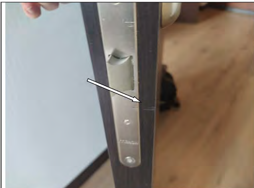
Фото №46. Дефекты (притертость) на лицевой поверхности полотна деревянного дверного блока в спальне.
