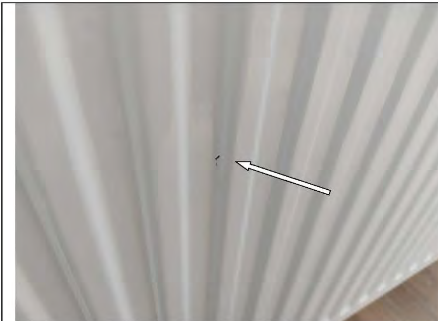
Фото №37. Отопительный прибор имеет дефект покраски защитного кожуха в спальне (скол).
