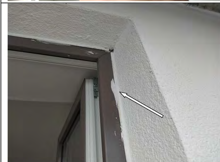
Фото №27. Профиль ПВХ оконно-дверного блока в спальне имеет дефекты (загрязнение малярными составами).
