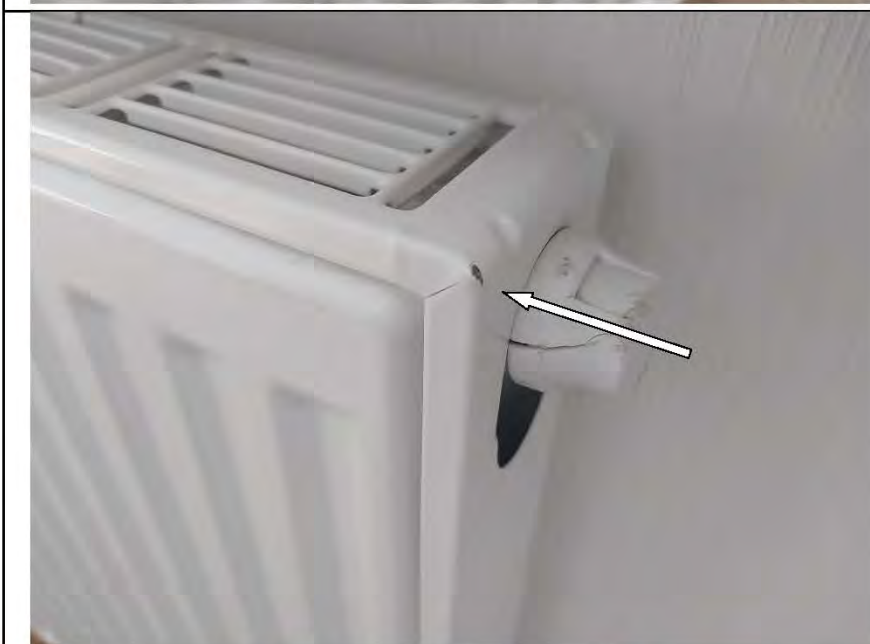
Фото №38. Отопительный прибор имеет дефект покраски защитного кожуха в гостиной (скол).
