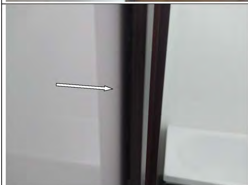
Фото №51. Неплотное прилегание наличника дверного блока к стене в ванной комнате.
