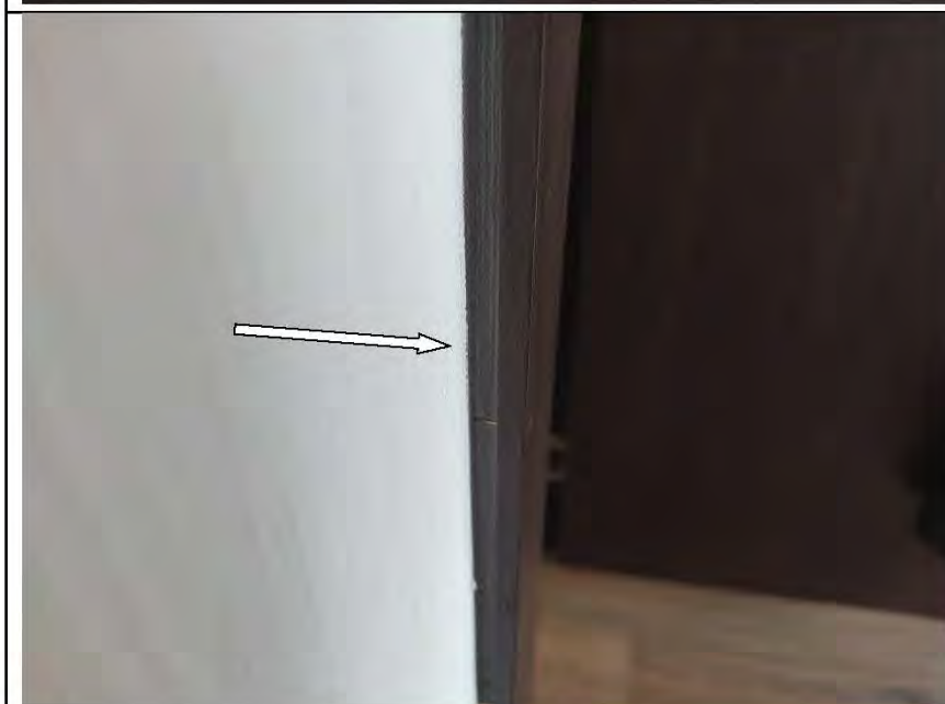
Фото №50. Неплотное прилегание наличника дверного блока к стене в гостиной.
