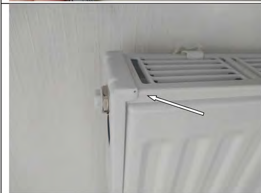
Фото №36. Отопительный прибор имеет дефект покраски защитного кожуха в кухне (скол).
