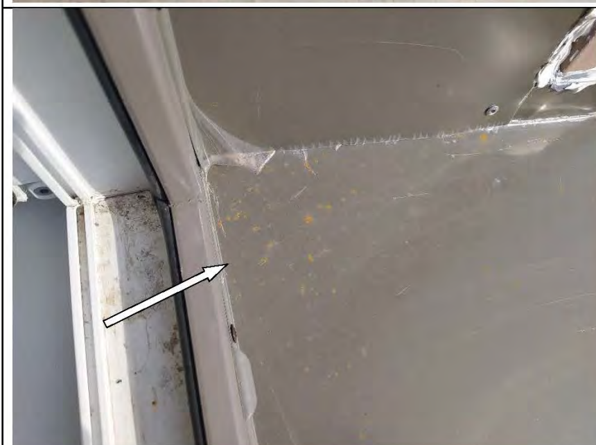
Фото №71. Металлический отлив оконного блока ПВХ в гостиной имеют дефекты (коррозия)
