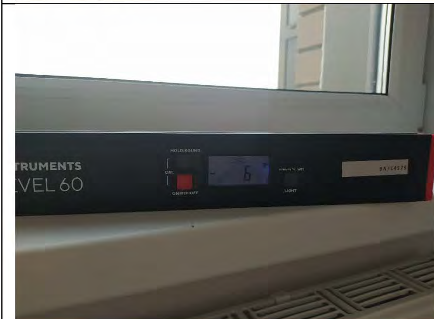
Фото №32. Отклонение по горизонтали подоконной доски в кухне.
