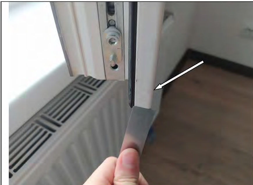
Фото №22. Профиль ПВХ оконного блока в кухне имеет дефекты (механическое повреждение).
