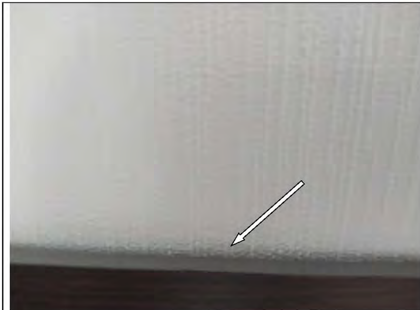
Фото №49. Неплотное прилегание наличника дверного блока к стене в спальне.
