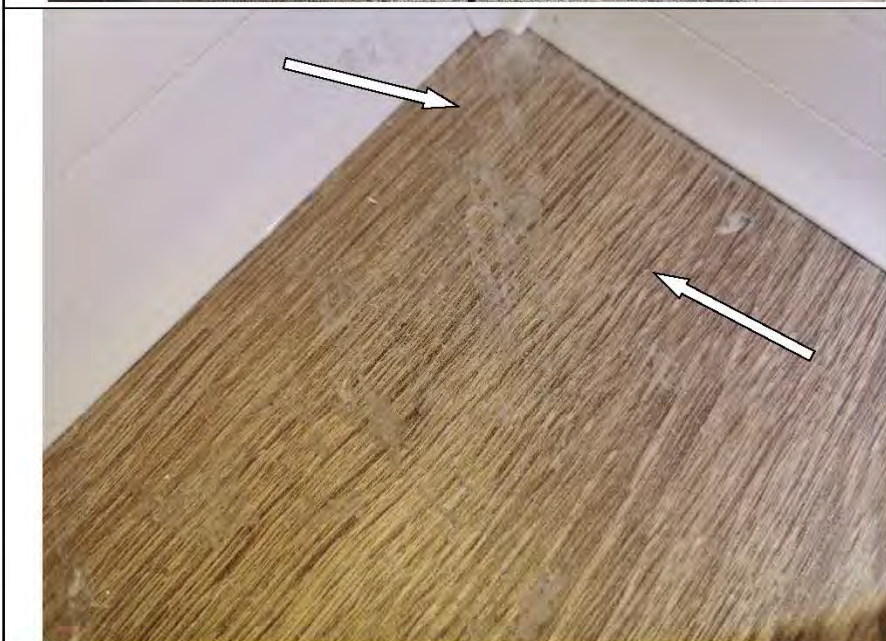
Фото №24. Загрязнение ламината в коридоре.
