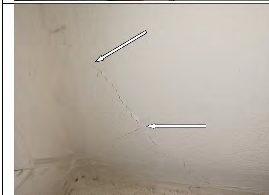
Фото №44. Окрашенные откосы оконного блока ПВХ выполнены с дефектами в спальне.
