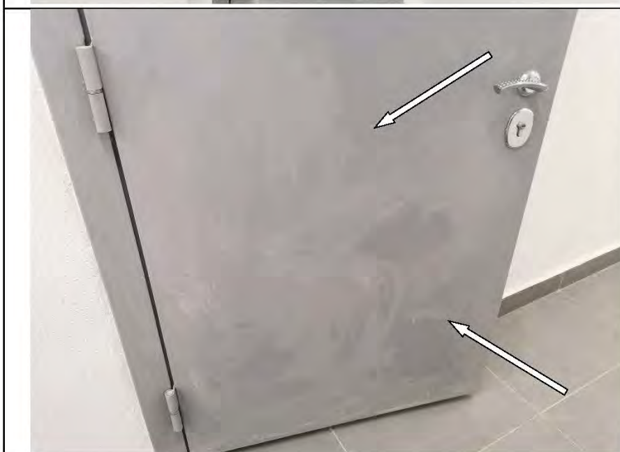
Фото №57. Загрязнение полотна входного дверного блока.
