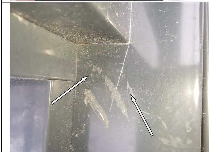
Фото №63. Царапины на профиле металлического оконного блока на лоджии.
