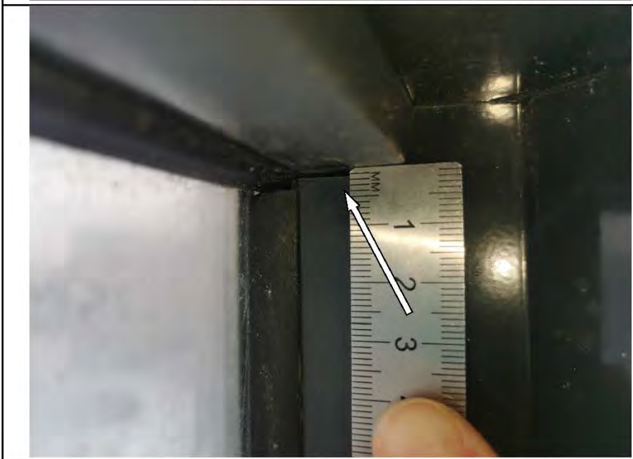
Фото №66. Зазор в месте стыка профилей металлического оконного блока на лоджии.
