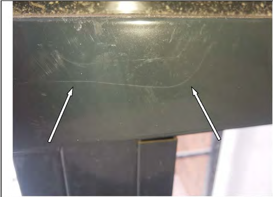
Фото №64. Царапины на профиле металлического оконного блока на лоджии.
