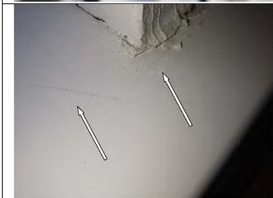
Фото №48. Царапины на лицевой поверхности подоконной доски дверного блока ПВХ на кухне.
