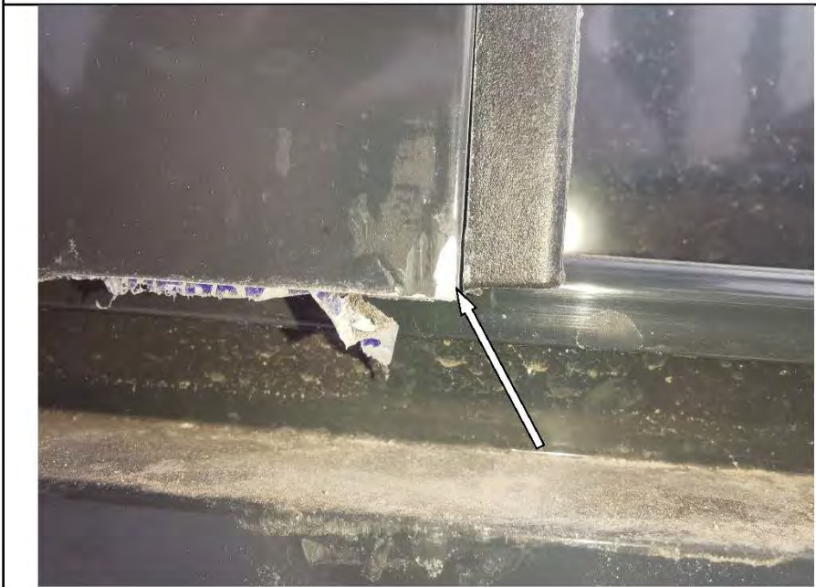
Фото №65. Потертости на профиле металлического оконного блока на лоджии.
