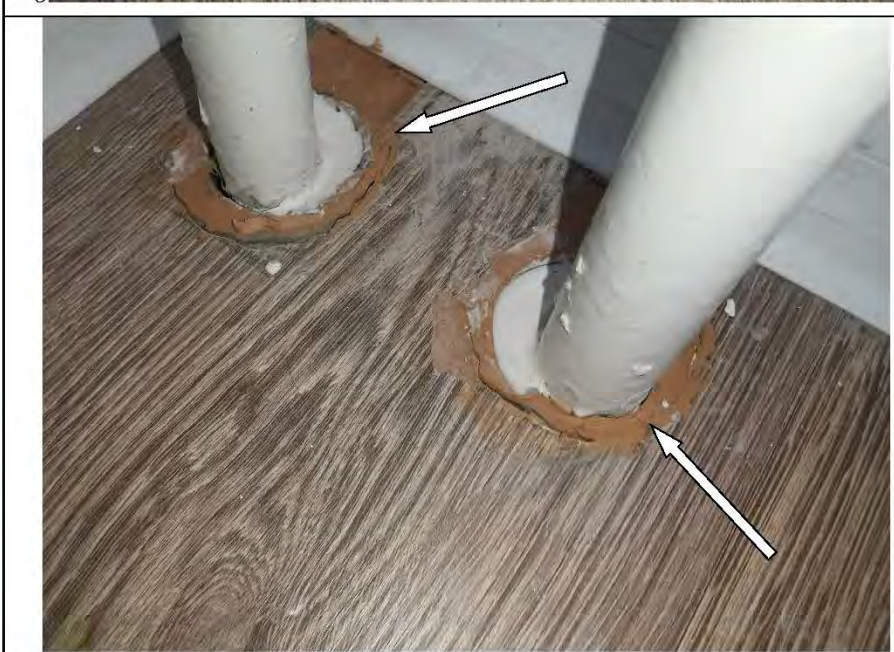
Фото №27. Заделка отверстия для трубопровода отопления в напольном покрытии из ламината выполнена с дефектом в спальне.
