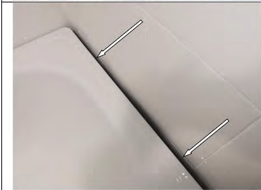
Фото №68. Не загерметизирован стык ванны со стеной.
