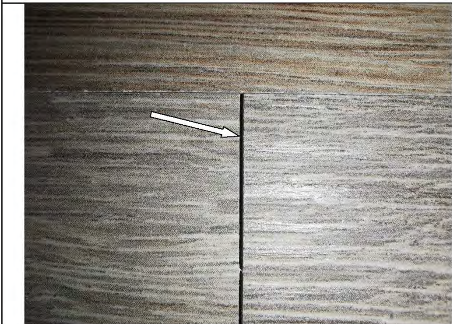
Фото №23. Зазор между соседними досками ламината в коридоре.
