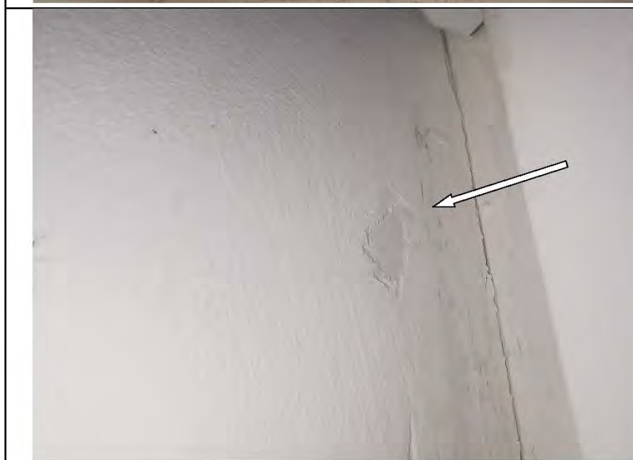
Фото №45. Окрашенные откосы оконного блока ПВХ выполнены с дефектами на кухне.
