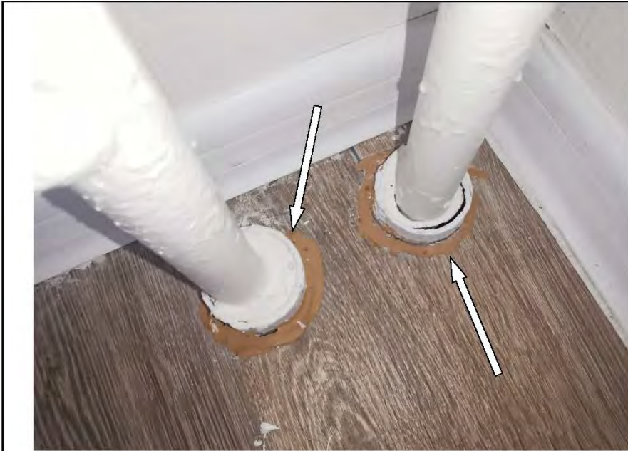
Фото №28. Заделка отверстия для трубопровода отопления в напольном покрытии из ламината выполнена с дефектом на кухне.
