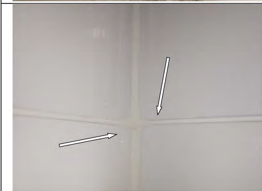
Фото №18. Затирка настенной плитки в ванной комнате выполнена с нарушениями.
