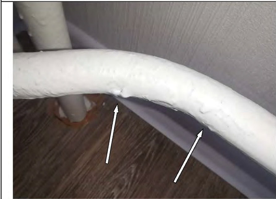
Фото №59. Окрашивание труб отопления выполнено с дефектами в спальне.
