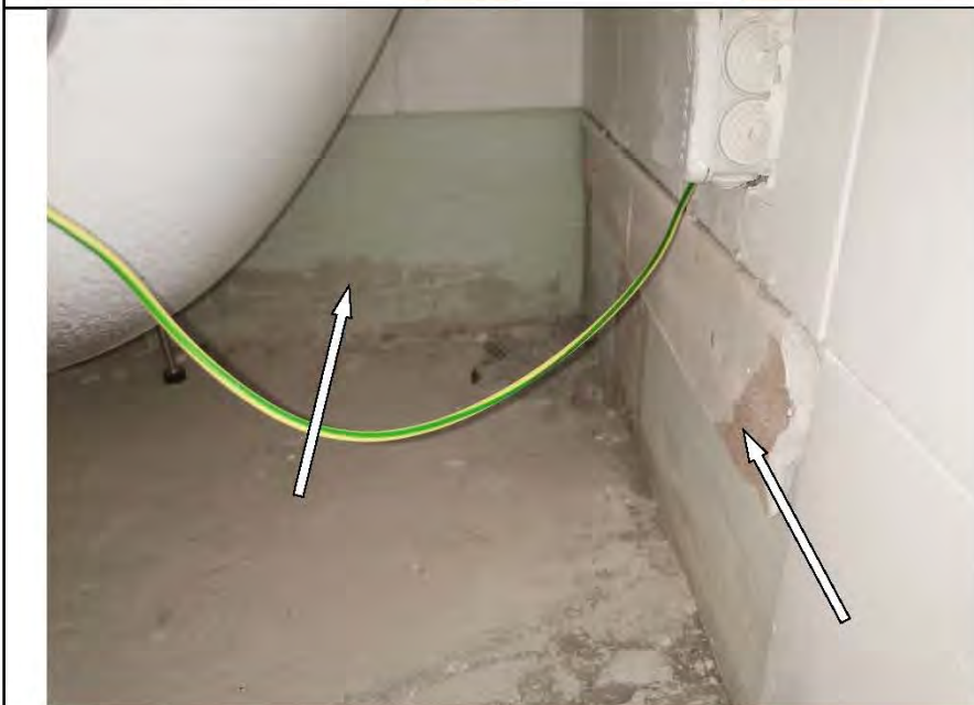
Фото №17. Частично отсутствует настенная керамическая плитка за ванной.
