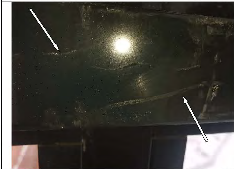
Фото №62. Царапины на профиле металлического оконного блока на лоджии.
