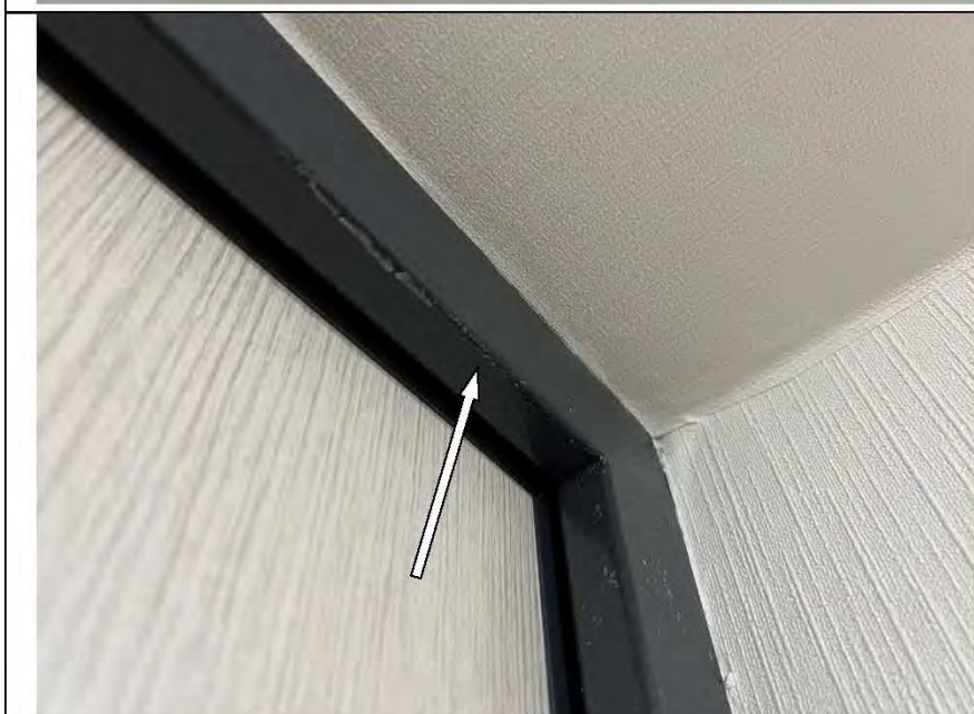
Фото №47. Царапины на коробке входного дверного блока.
