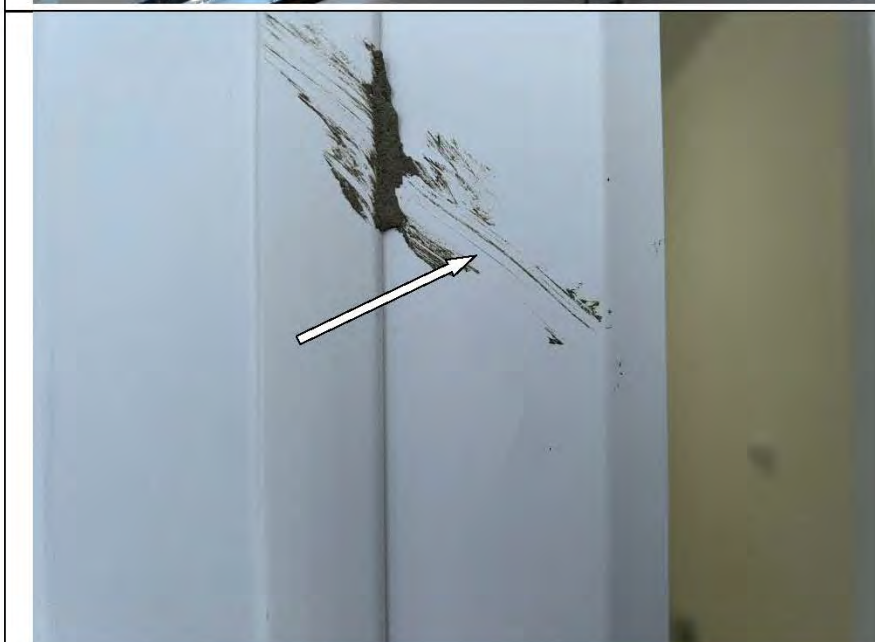
Фото №35. Царапина на профиле ПВХ балконного блока в кухне.
