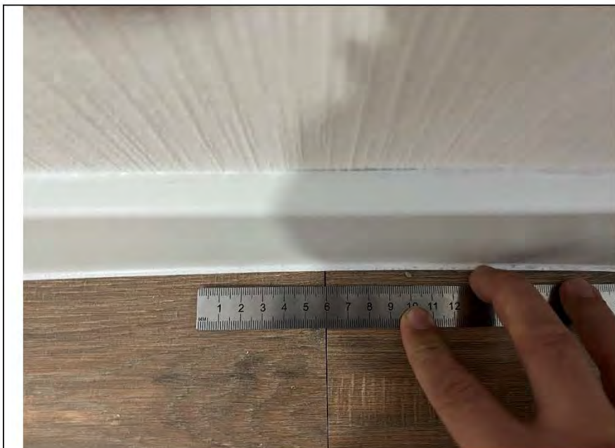
Фото №28. Зазор между соседними досками ламината в спальне составляет 1 мм.
