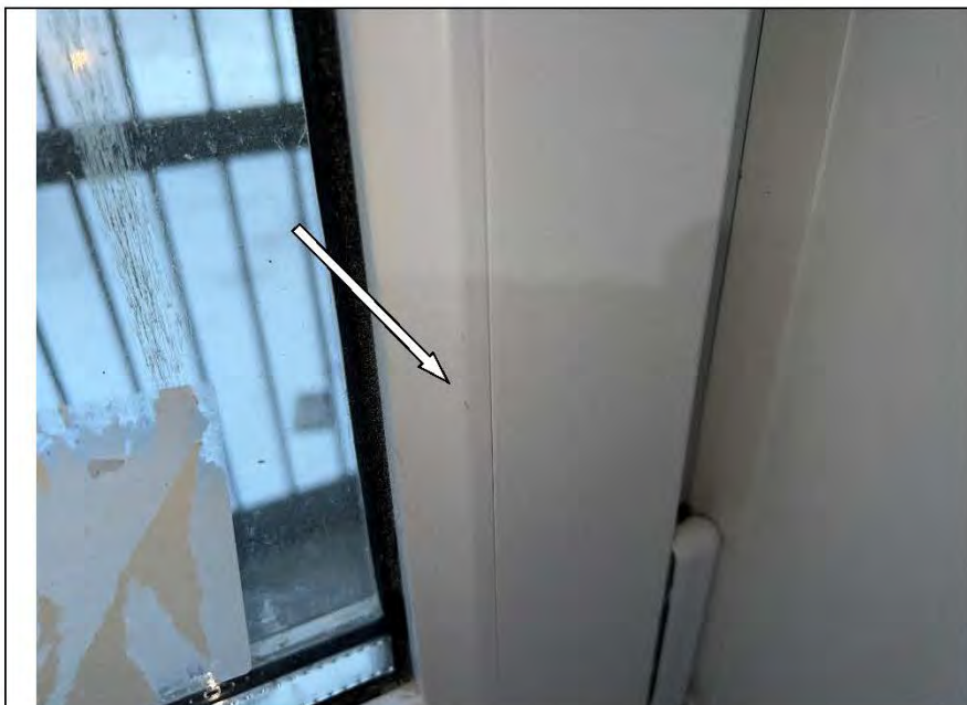
Фото №34. Царапина на профиле ПВХ оконного блока в кухне.
