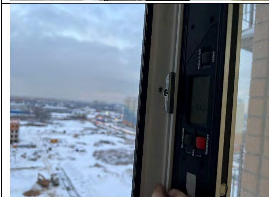
Фото №38. Отклонение оконного блока ПВХ в спальне по уровню вертикальности составляет 3 мм.
