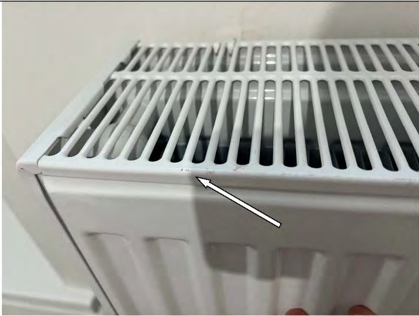
Фото №55. Скол лицевой поверхности радиатора в кухне.
