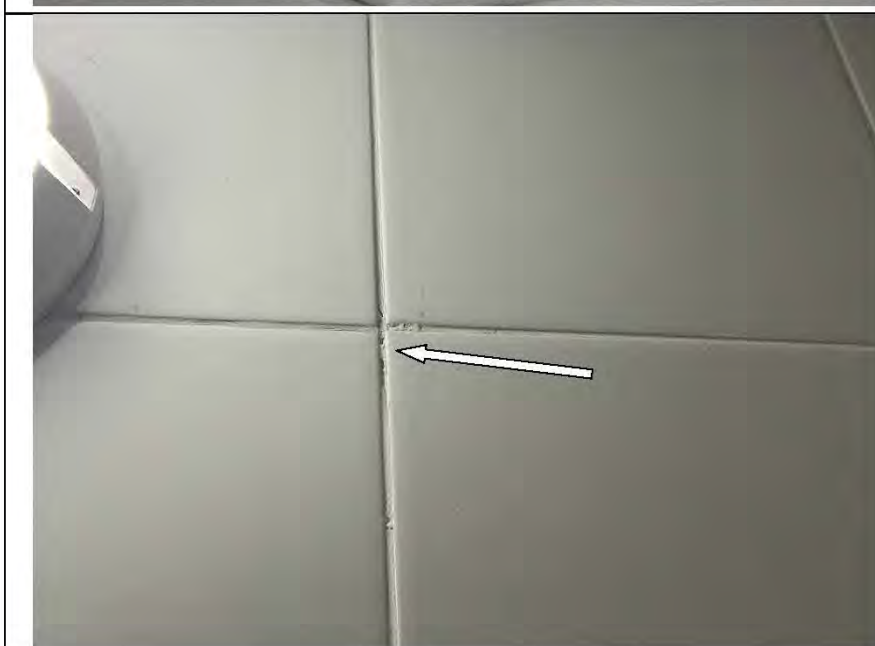
Фото №21. Трещины затирочного раствора в шовном пространстве настенной керамической плитки в ванной комнате.
