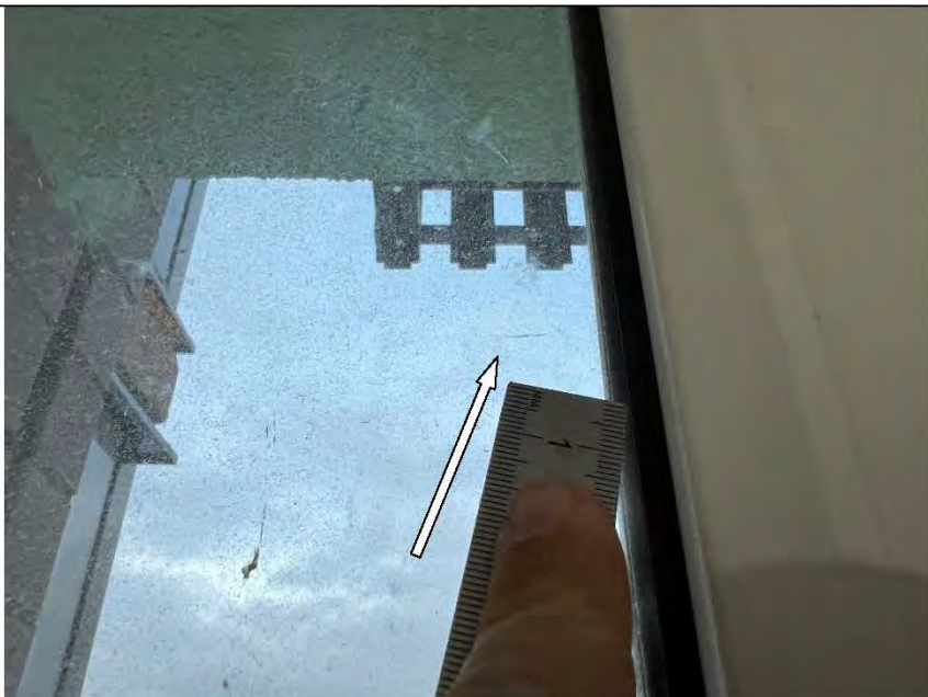
Фото №31. Механические повреждения на стеклопакете оконного блока ПВХ в спальне.
