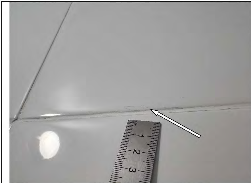
Фото №22. Царапина на лицевой поверхности настенной керамической плитки в ванной комнате.
