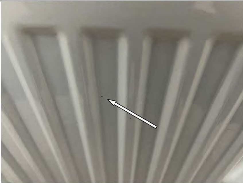
Фото №56. Скол лицевой поверхности радиатора в спальне.
