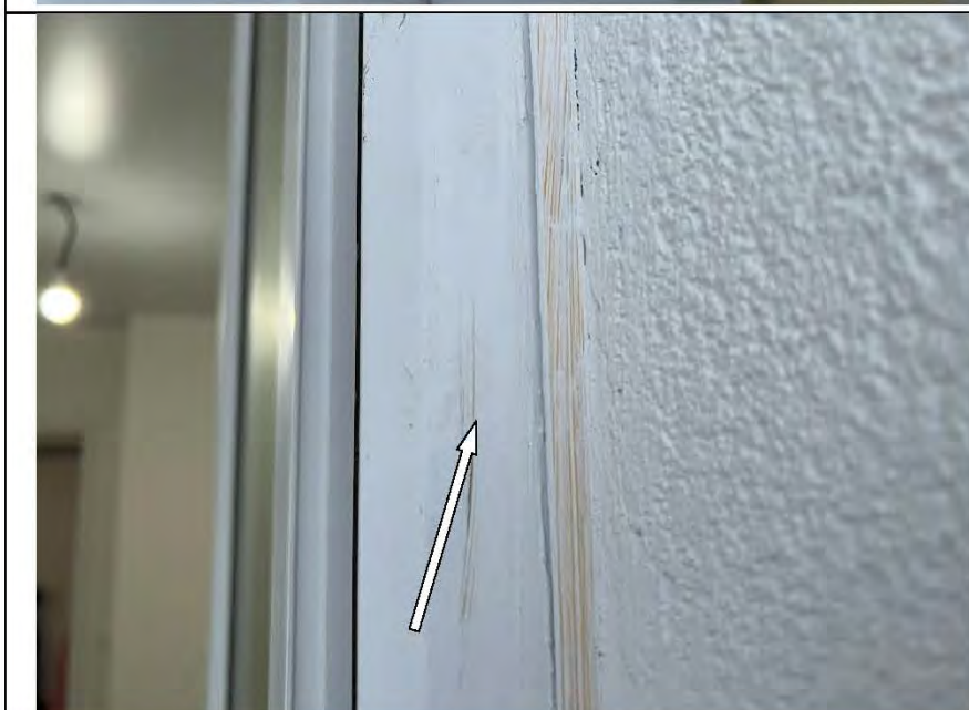
Фото №36. Царапина на профиле ПВХ балконного блока в кухне.
