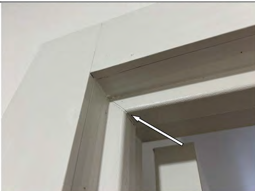
Фото №51. Элементы дверного блока соединены не надежно в спальне.
