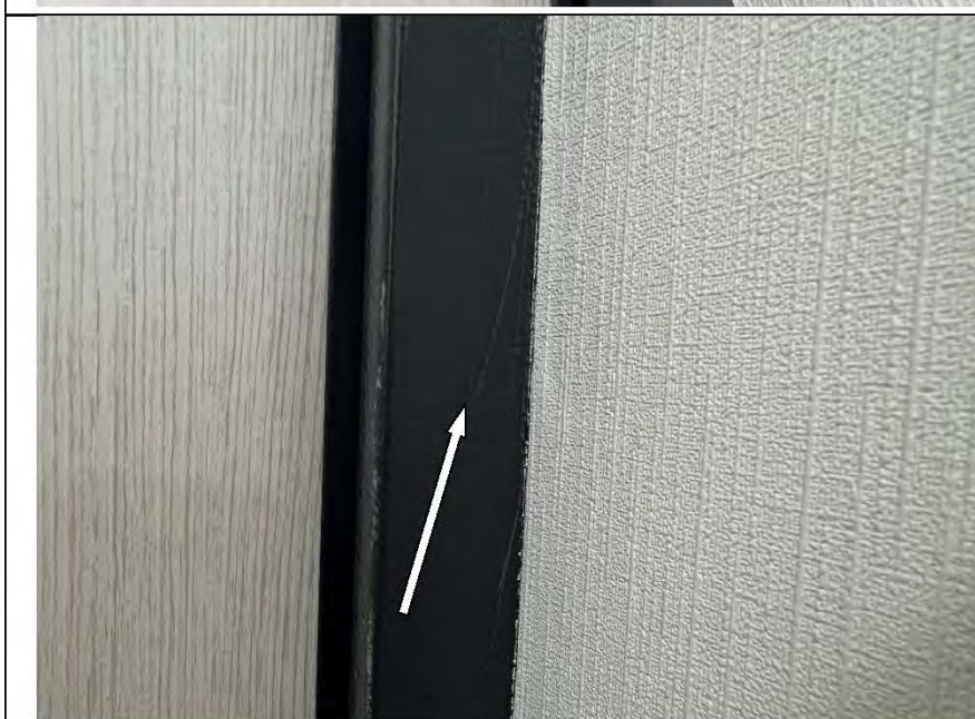
Фото №48. Царапины на коробке входного дверного блока.
