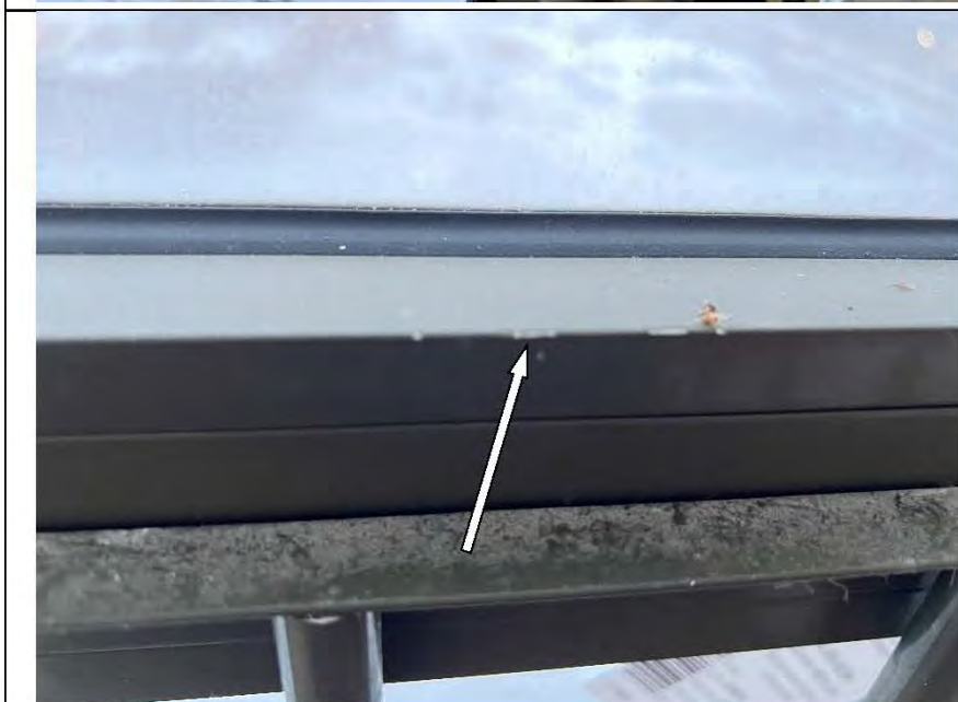
Фото №39. Царапины на металлическом профиле оконного блока на балконе.
