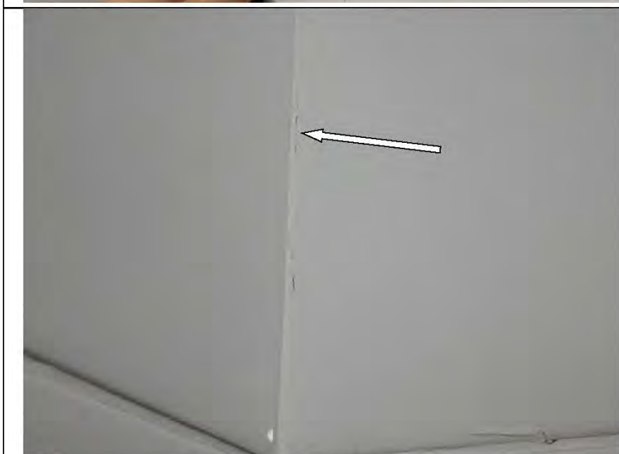
Фото №20. Трещины затирочного раствора в шовном пространстве настенной керамической плитки в ванной комнате.
