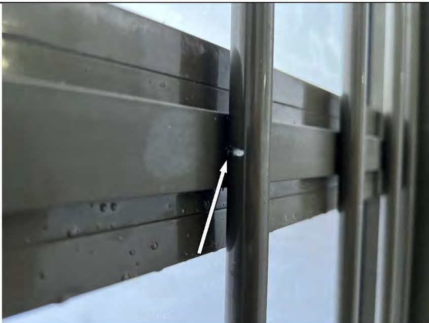
Фото №41. Царапина на металлическом профиле ограждения балкона.
