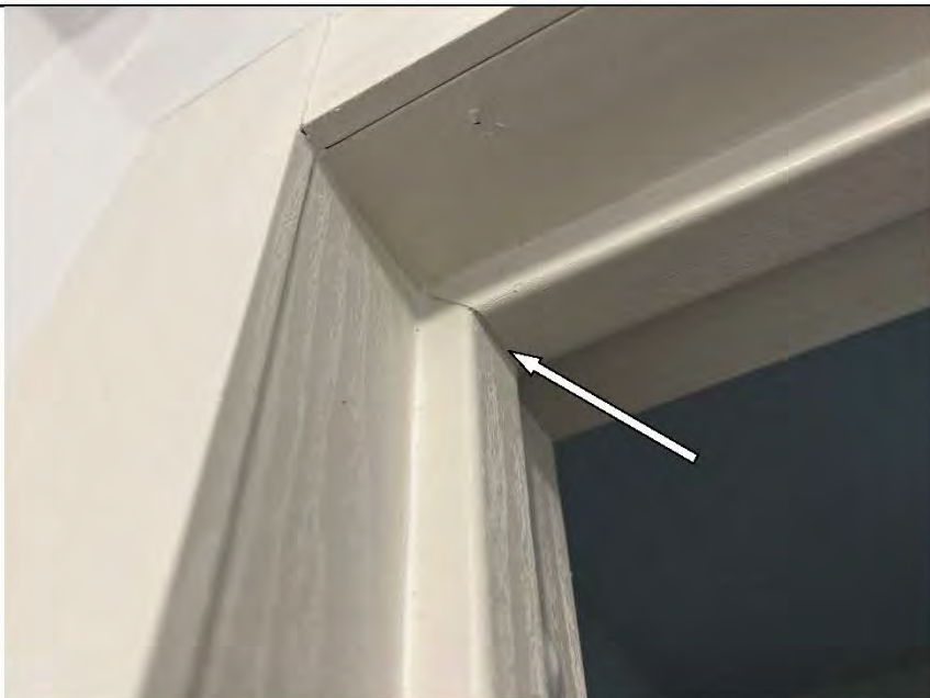
Фото №50. Элементы дверного блока соединены не надежно в ванной комнате.
