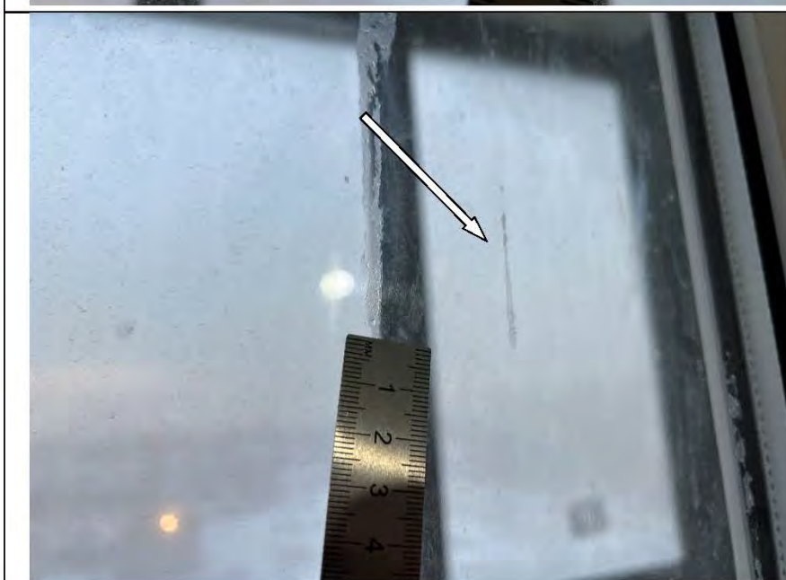
Фото №30. Механические повреждения на стеклопакете оконного блока ПВХ в кухне.
