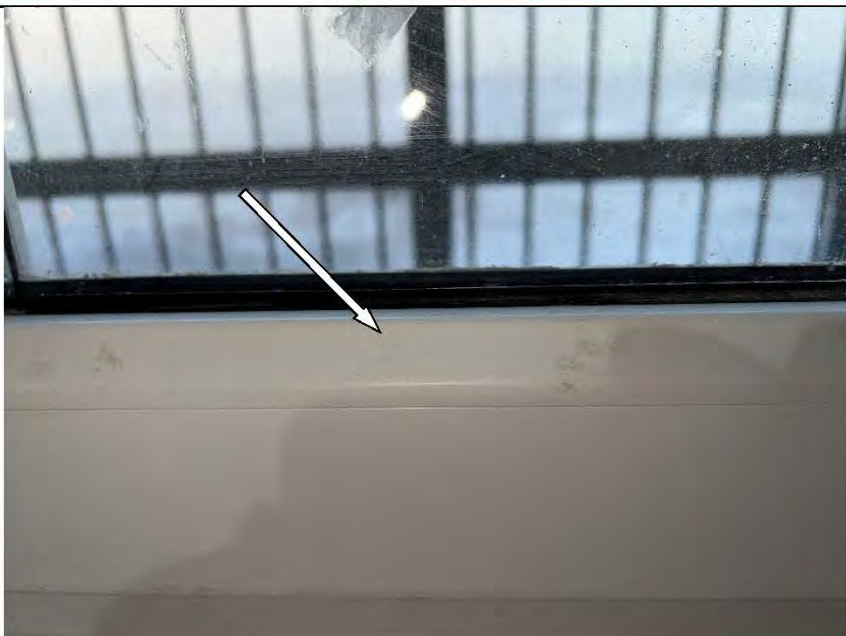
Фото №33. Царапина на профиле ПВХ оконного блока в кухне.
