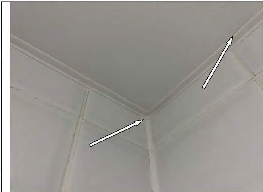
Фото №40. Дефект монтажа декоративного молдинга натяжного потолка в санузле (зазор).
