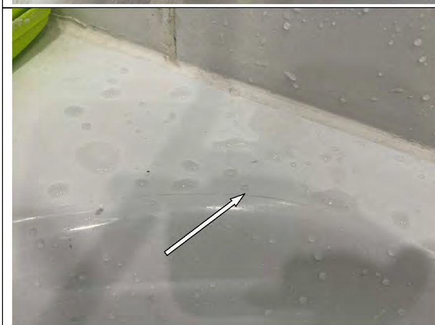
Фото №54. Дефект ванны (царапина).
