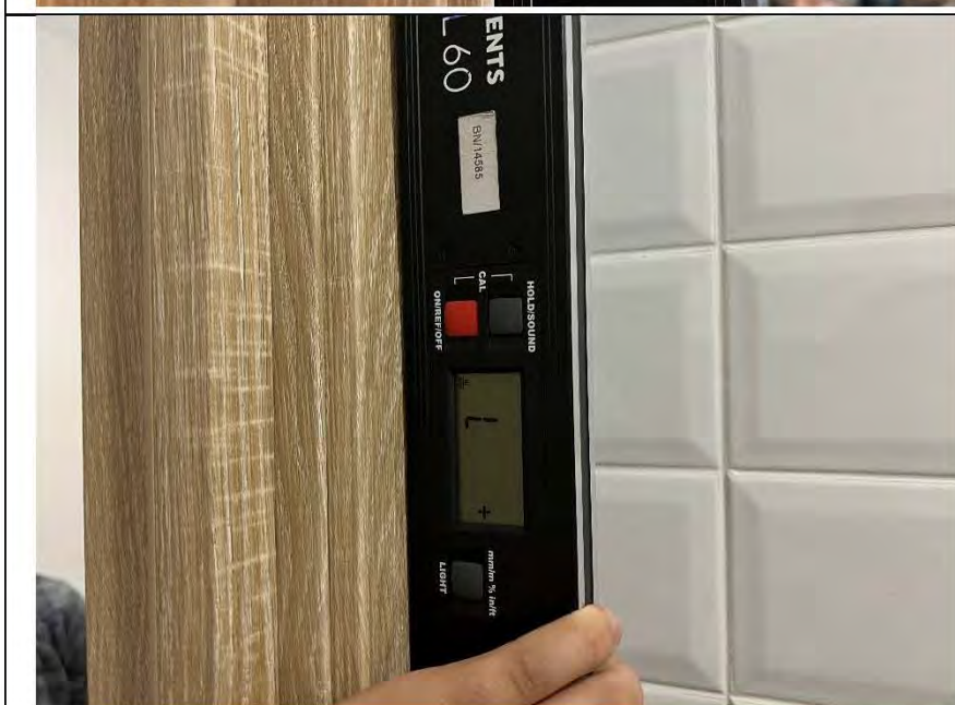
Фото №45. Отклонение наличников дверного блока в санузле равно 7 мм.
