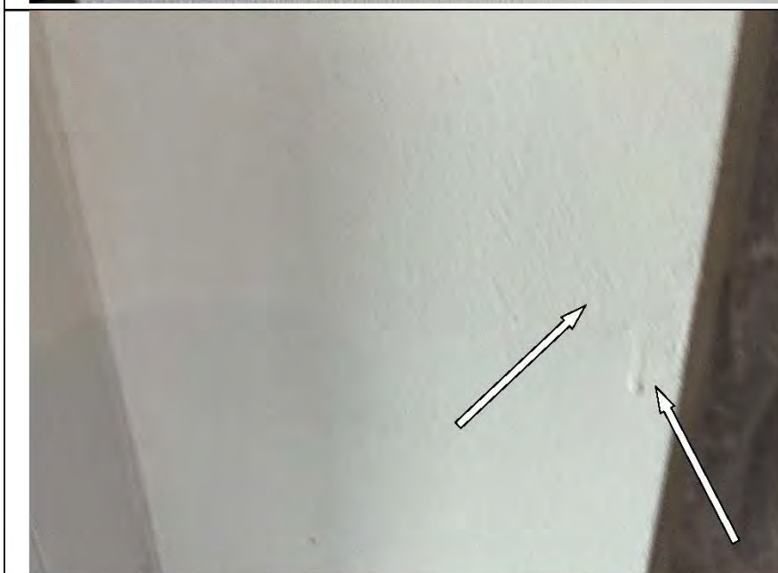
Фото №29. Подтеки краски на откосе оконного блока ПВХ в спальне.
