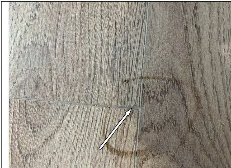
Фото №25. Скол лицевой поверхности доски ламината в спальне.
