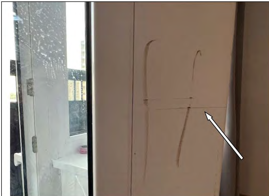
Фото №34. Царапины на лицевой поверхности профилей оконного блока ПВХ в спальне.
