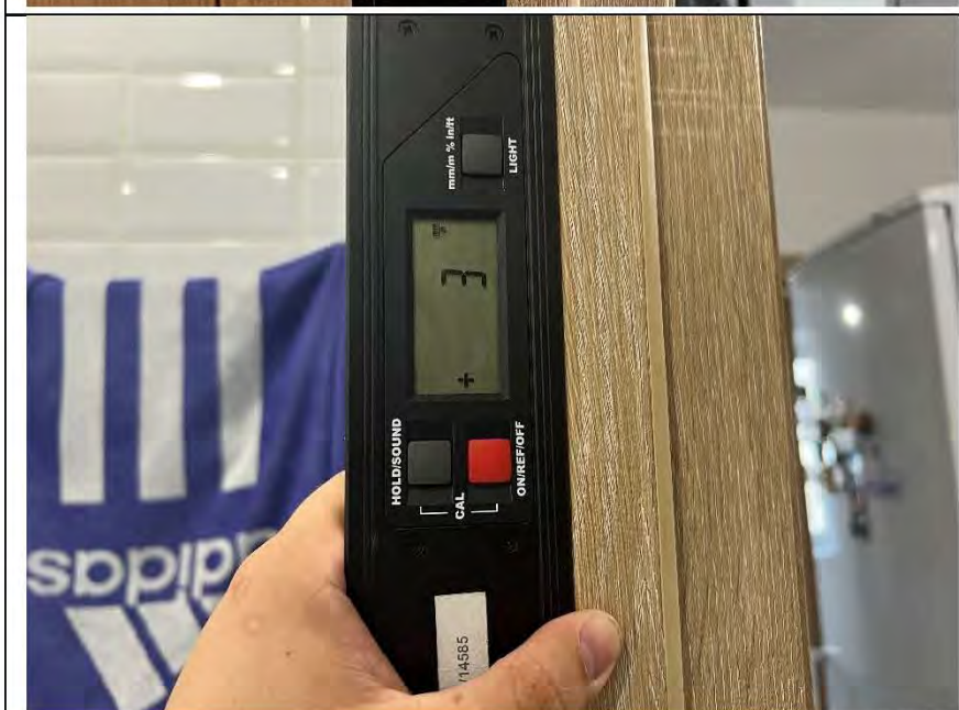
Фото №48. Отклонение коробки от плоскостности и прямолинейности дверного блока в ванной комнате равняется 3 мм.
