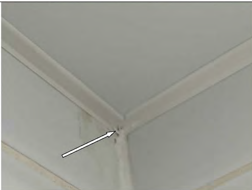
Фото №39. Дефект монтажа декоративного молдинга натяжного потолка в ванной комнате (зазор).
