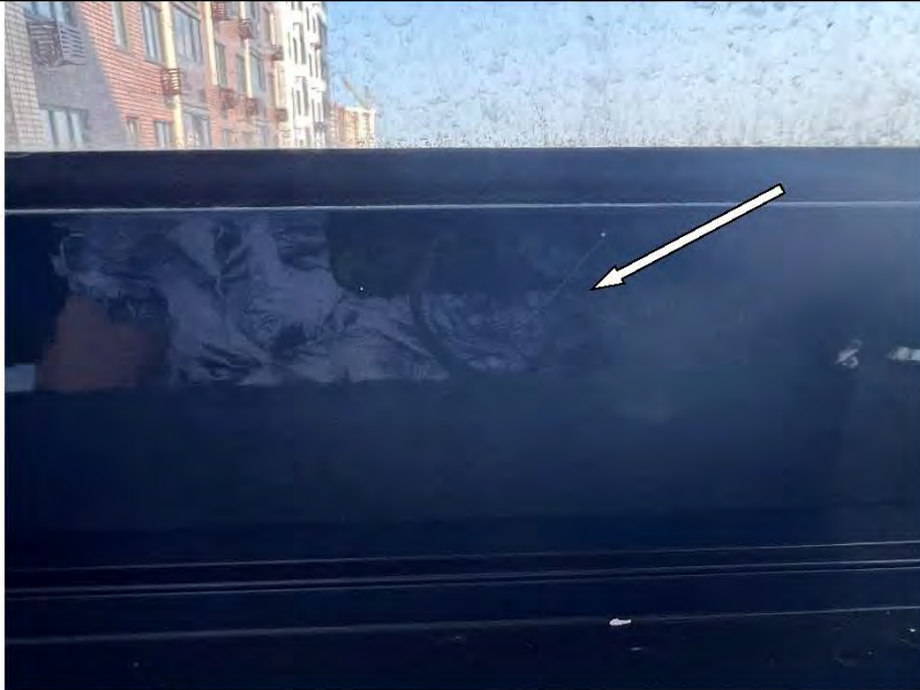
Фото №37. Царапины на металлическом профиле оконного блока на лоджии.
