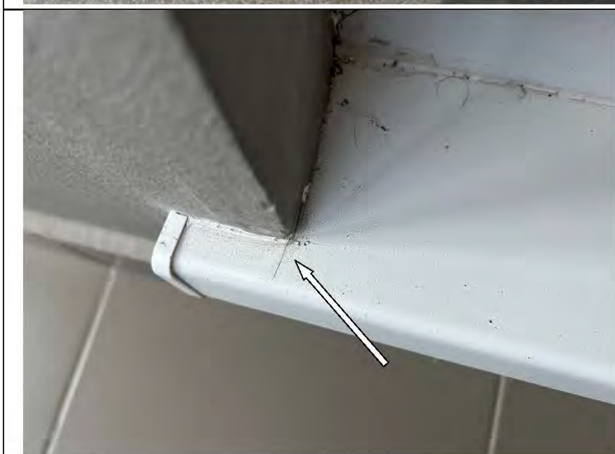
Фото №27. Царапины на лицевой поверхности подоконной доски на лоджии.
