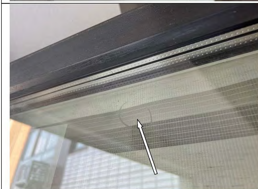
Фото №30. Окалины на внутреннем стеклопакете оконного блока ПВХ в кухне.
