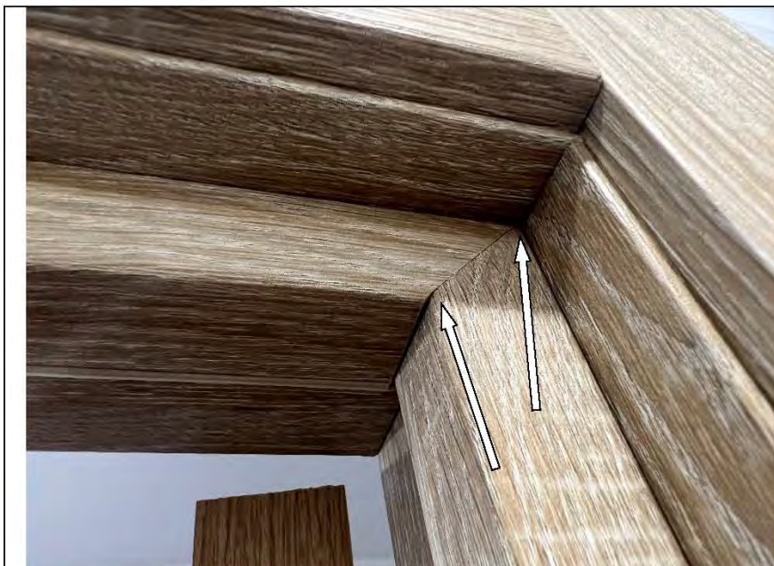
Фото №46. Элементы дверного блока в ванной комнате соединены не надежно (коробка).
