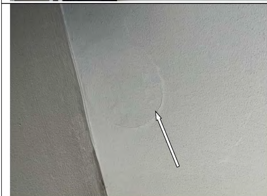
Фото №17. Подтеки краски на стенах на лоджии.
