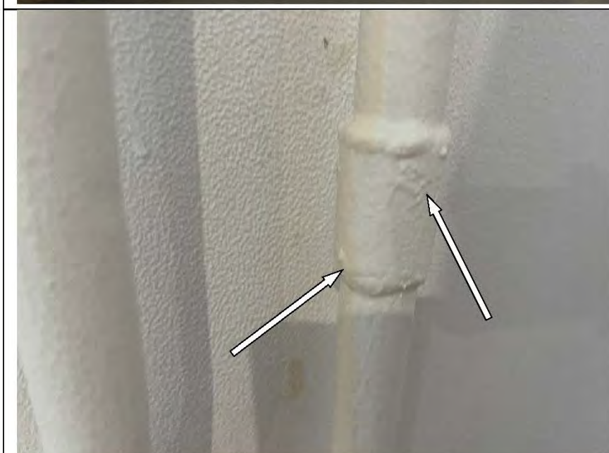
Фото №53. Подтеки краски на трубах отопления в спальне.
