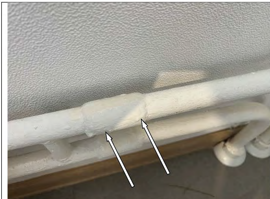
Фото №52. Подтеки краски на трубах отопления в кухне.
