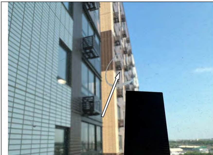
Фото №31. Окалины на внутреннем стеклопакете оконного блока ПВХ в кухне.
