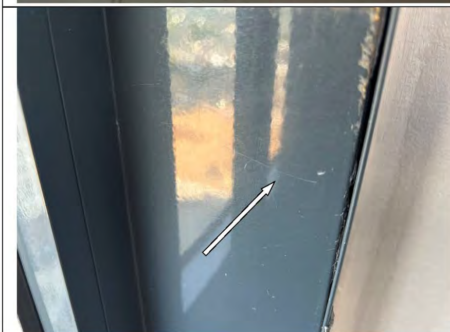
Фото №36. Царапины на металлическом профиле оконного блока на лоджии.
