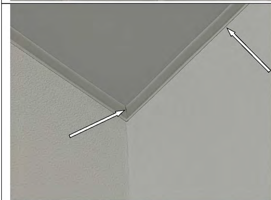
Фото №41. Дефект монтажа декоративного молдинга натяжного потолка в спальне (зазор).
