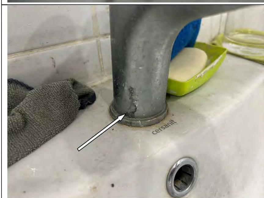
Фото №57. Потертости на смесителе раковины в ванной комнате.
