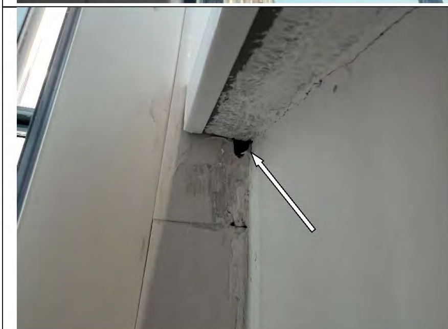
Фото №33. Отверстие под подоконником не за герметизировано в спальне.
