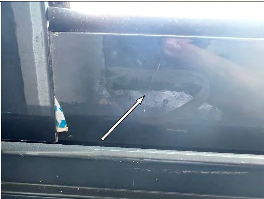
Фото №38. Царапины на металлическом профиле оконного блока на лоджии.
