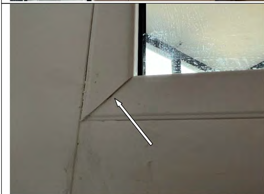
Фото №35. Зазоры в стыках профилей ПВХ оконного блока в спальне.
