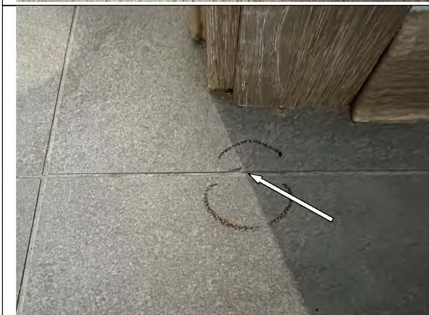
Фото №26. Отбитости напольной керамической плитки в кухне.
