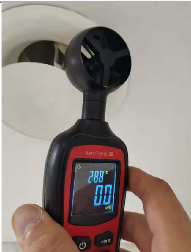
Фото 154. Санузел (3,4 кв.м.) 4.13 Не работает вентиляция
