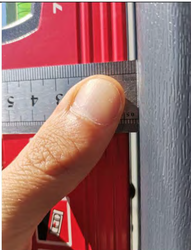
Фото 117. Комната (15,7 кв.м.) 3.15 Отклонение оконной створки оконного блока от плоскости 3 мм
