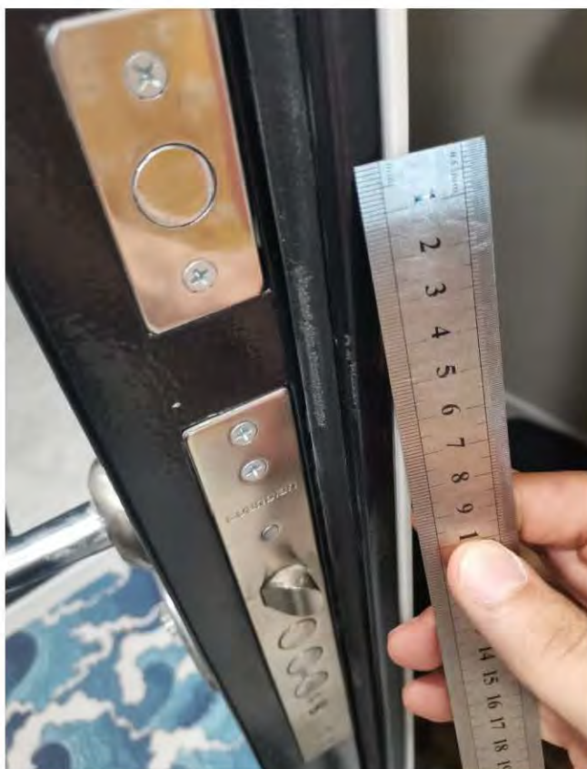
Фото 13-19. Коридор (3,2 кв.м.) 1.1 На входной двери имеются царапины, сколы, следы коррозии
