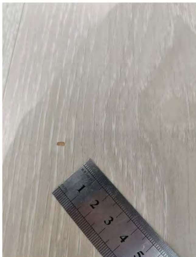
Фото 95-97. Комната (15,7 кв.м.) 3.7 Наличие сколов на напольном покрытии из ламинированной доски
