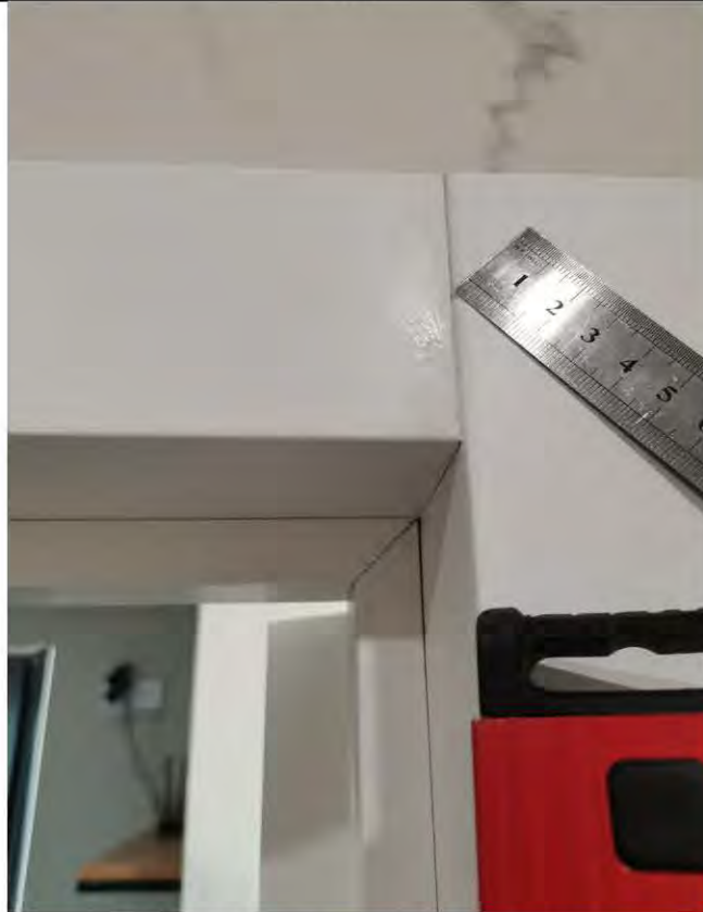
Фото 139. Санузел (3,4 кв.м.) 4.6 Некачественная герметизация между смежными элементами дверного блока
