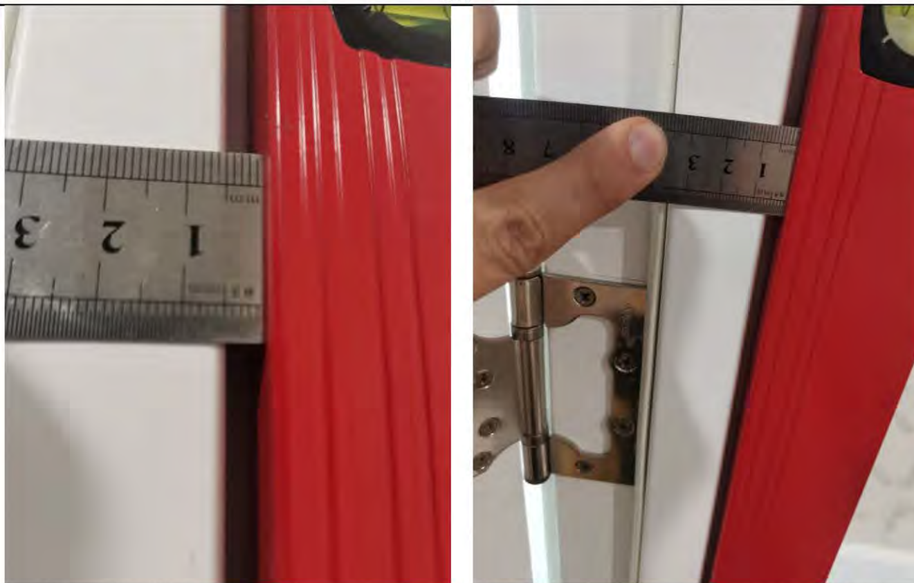
Фото 136-137. Санузел (3,4 кв.м.) 4.4 Дверной блок имеет отклонение от вертикали 5 мм
