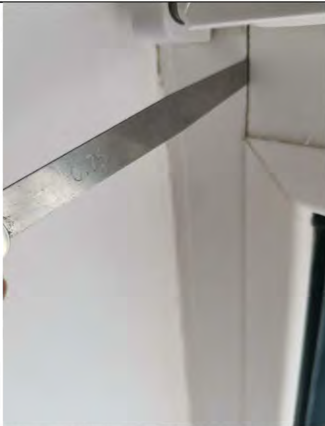
Фото 73. Кухня (20,1 кв.м.) 2.10 Зазор 0,75 мм между элементами оконного блока
