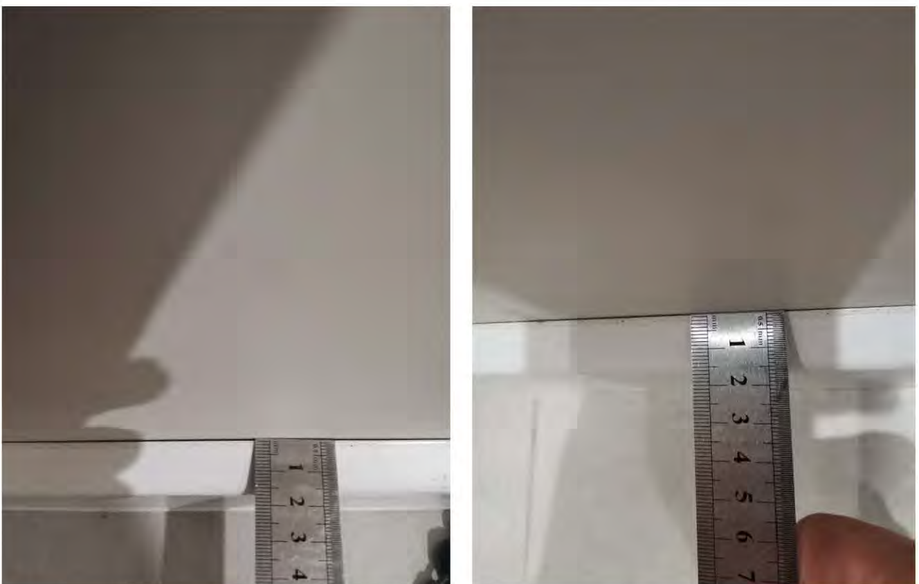
Фото 34-35. Коридор (3,2 кв.м.) 1.6 Зазор 1 мм между стеной и напольным плинтусом
