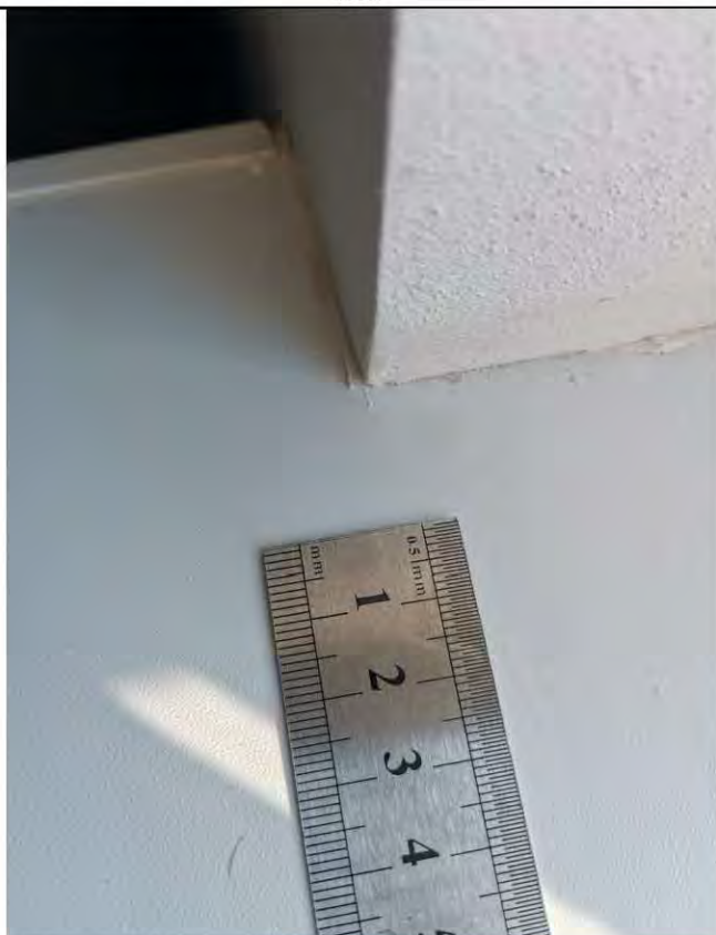
Фото 76. Кухня (20,1 кв.м.) 2.12 Царапина на подоконной доске
