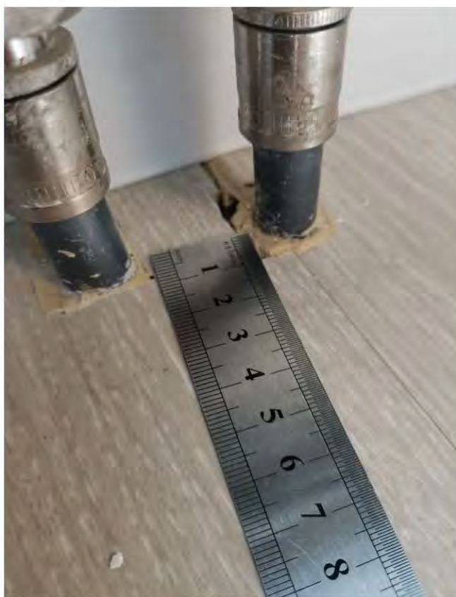
Фото 99. Комната (15,7 кв.м.) 3.9 Примыкание труб отопления к полу выполнено не качественно
