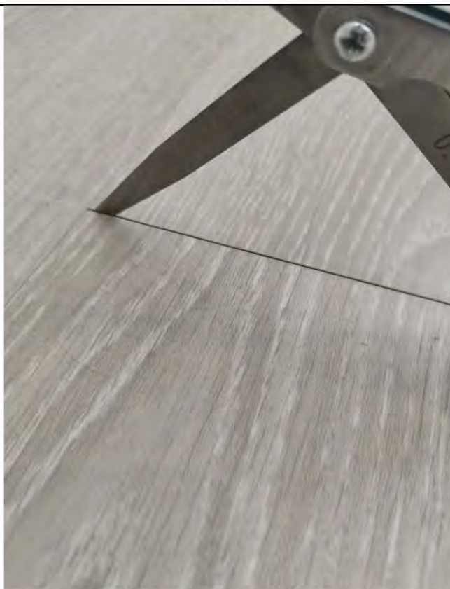
Фото 98. Комната (15,7 кв.м.) 3.8 Зазор между смежными ламинированными досками 0,3 мм
