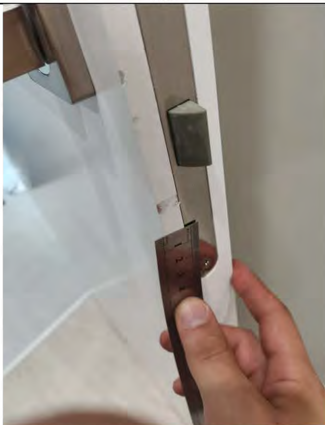
Фото 78-82. Комната (15,7 кв.м.) 3.1 На дверном блоке имеются сколы, потертости и отслоения ламинации
