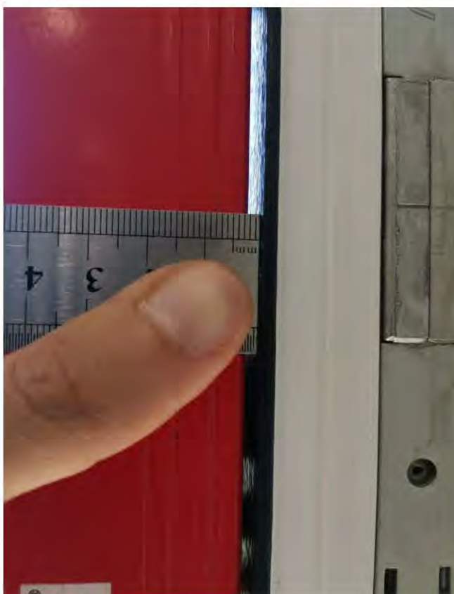
Фото 68. Кухня (20,1 кв.м.) 2.7 Отклонение оконной створки оконного блока от плоскости 2,5 мм
