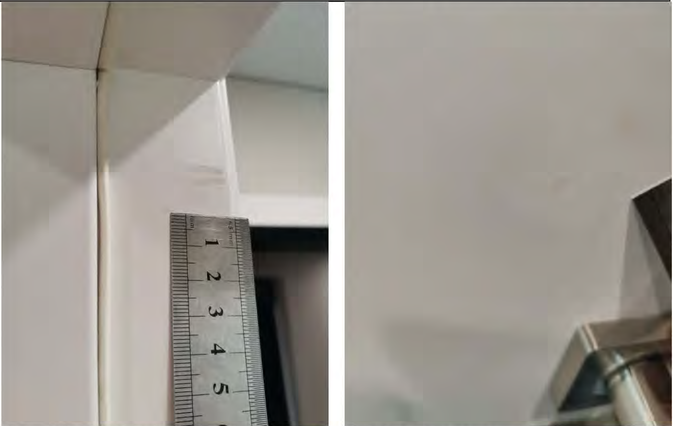
Фото 128-131. Санузел (3,4 кв.м.) 4.1 На дверном блоке имеются сколы, царапины, потертости, загрязнения
