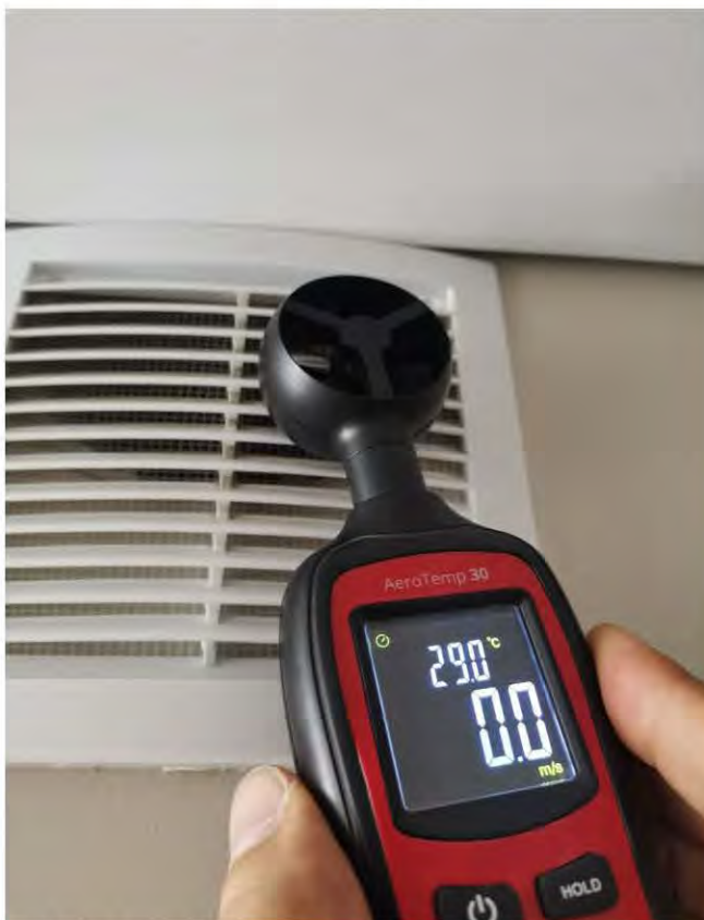
Фото 77. Кухня (20,1 кв.м.) 2.13 Не работает вентиляция
