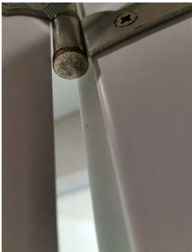
Фото 133-135. Санузел (3,4 кв.м.) 4.3 Потертости, следы коррозии на фурнитуре
