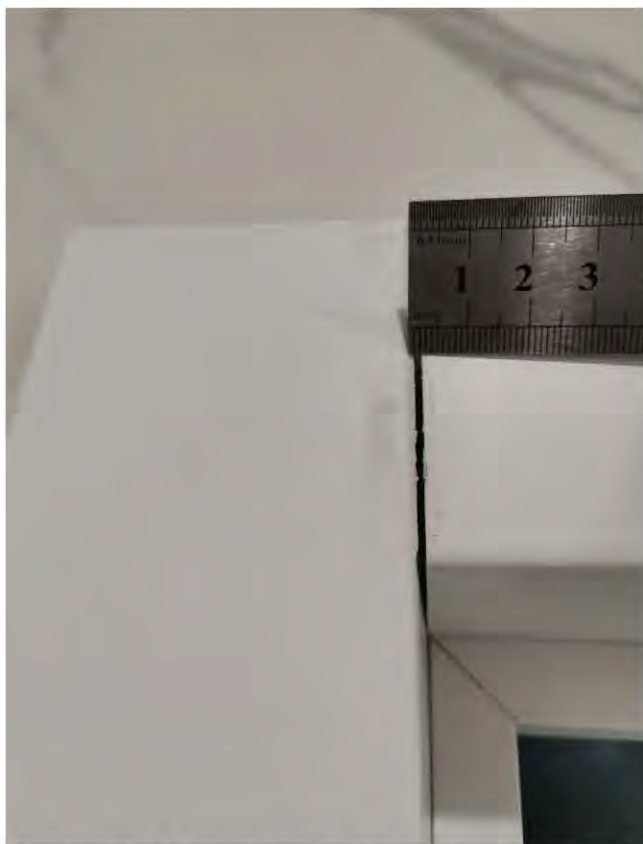
Фото 138. Санузел (3,4 кв.м.) 4.5 На дверном блоке имеется зазор 1 мм между смежными элементами
