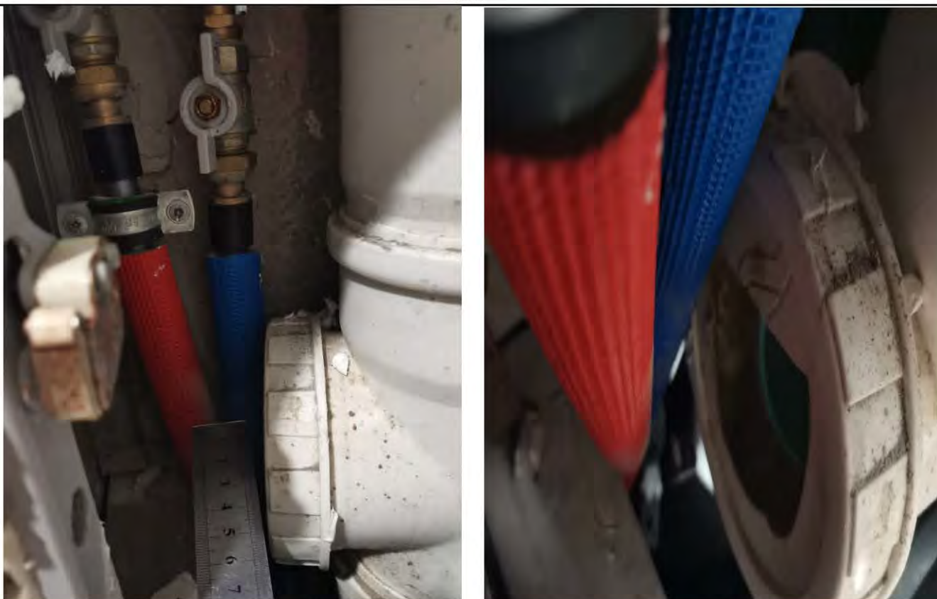
Фото 157-158. Санузел (3,4 кв.м.) 4.15 Отверстие в крышке от стояка канализации
