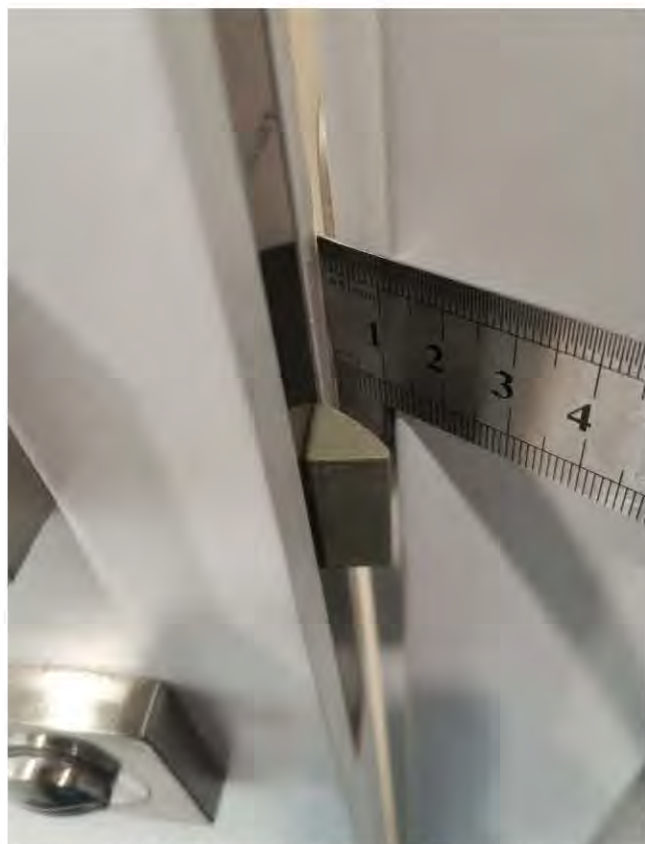
Фото 132. Санузел (3,4 кв.м.) 4.2 Дверной блок не обеспечивает нормальное закрывание
