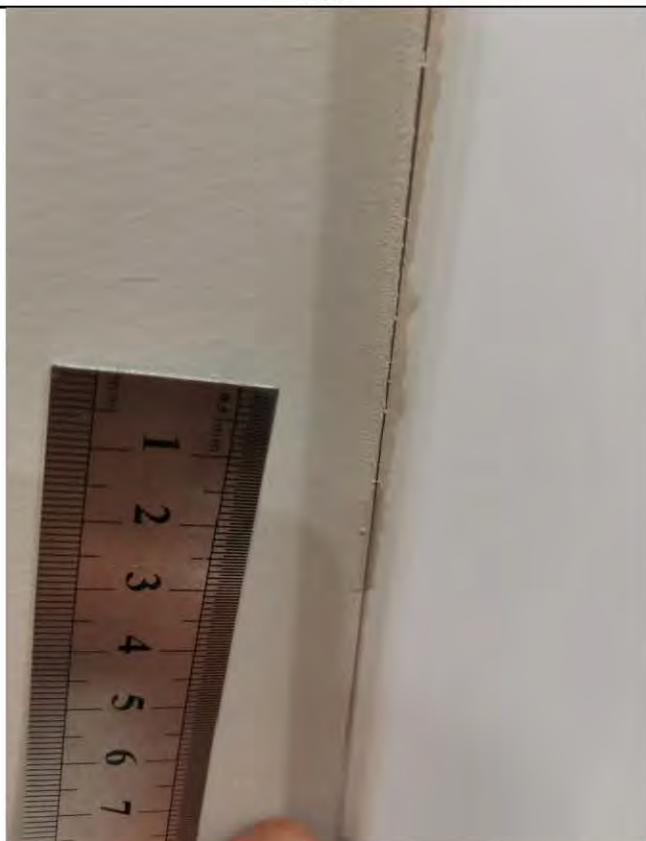
Фото 36. Коридор (3,2 кв.м.) 1.7 Зазор между стеной и дверным наличником входной двери
