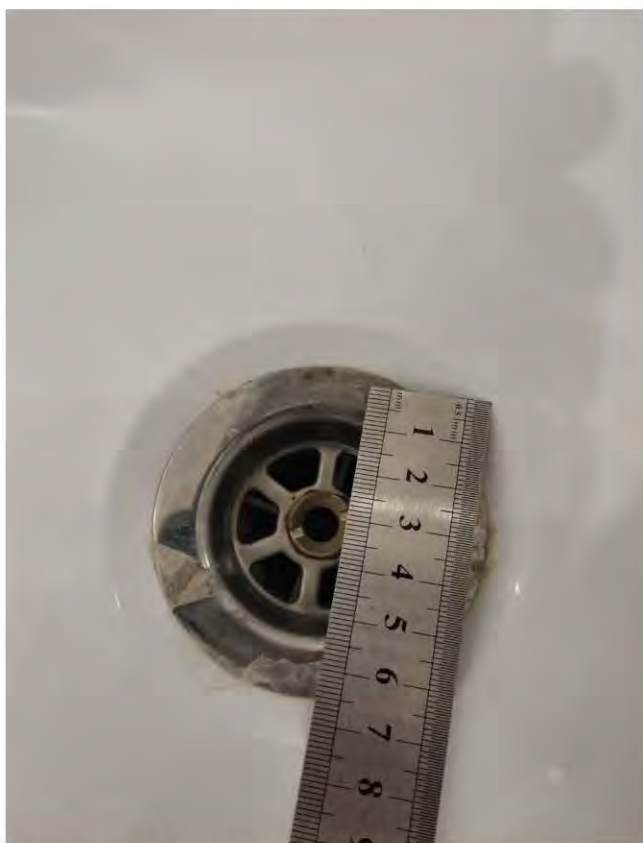
Фото 148-150. Санузел (3,4 кв.м.) 4.11 Следы коррозии на поверхностях отражателей смесителя и ванной чаши
