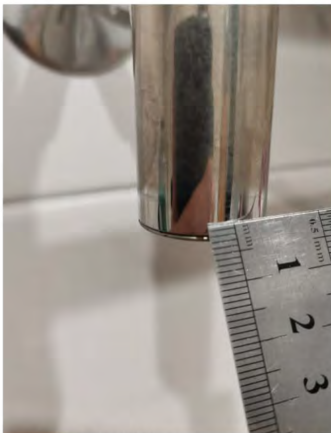
Фото 151-153. Санузел (3,4 кв.м.) 4.12 Следы коррозии на поверхностях отражателей полотенцесушителя
