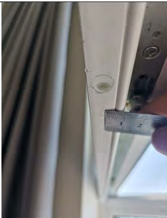
Фото 63-67. Кухня (20,1 кв.м.) 2.6 Наличие царапин, потертостей, трещины на лицевой поверхности оконного блока
