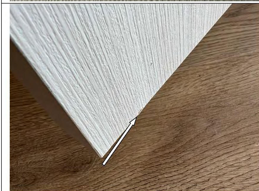
Фото №90. Отслоение ламинации на поверхности полотна дверного блока в санузле.
