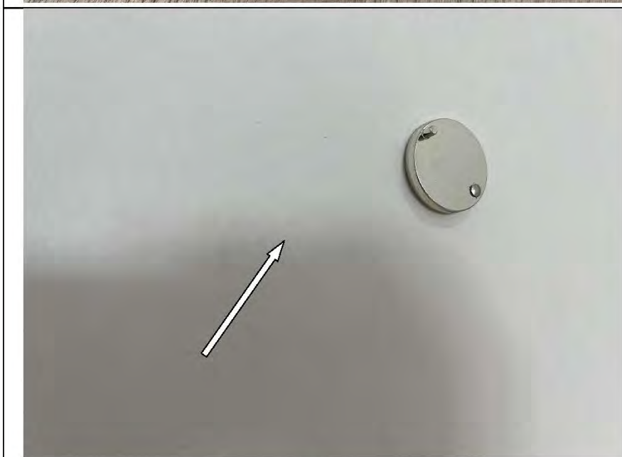
Фото №92. Царапина на полотне входного дверного блока.
