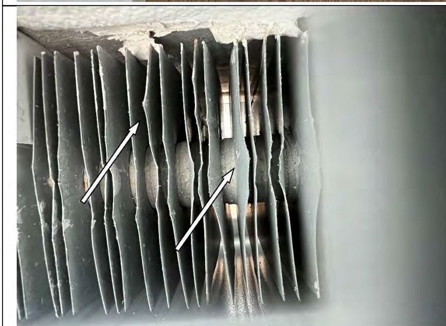
Фото №98. Замытие сот радиатора в спальне.
