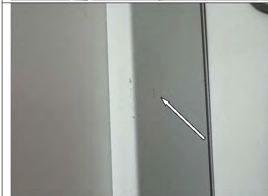
Фото №78. Царапина на коробке входного дверного блока.
