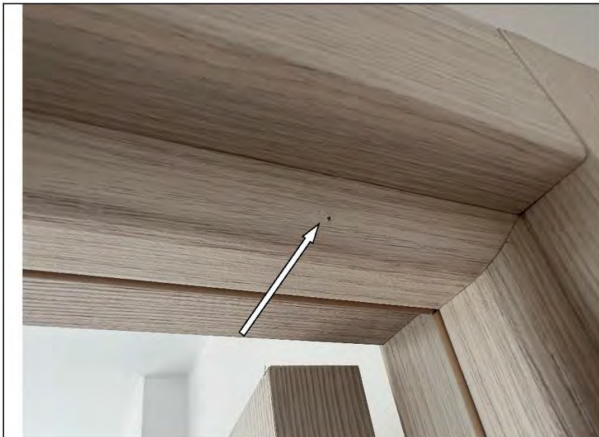
Фото №88. Скол на коробке дверного блока в гостиной.
