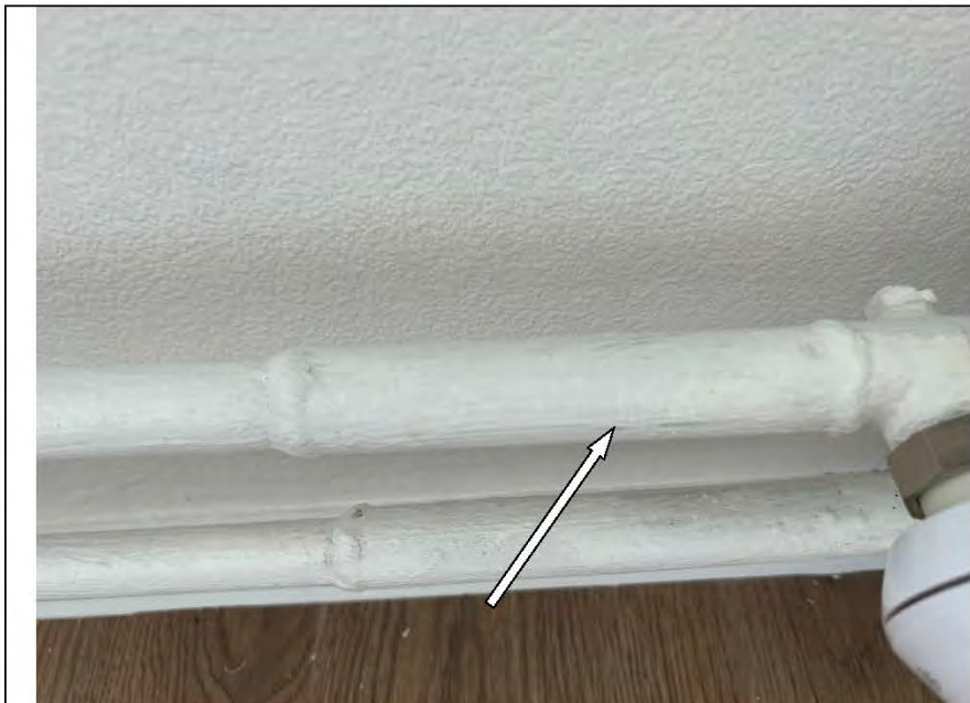
Фото №94. Подтеки краски на трубах отопления в спальне.
