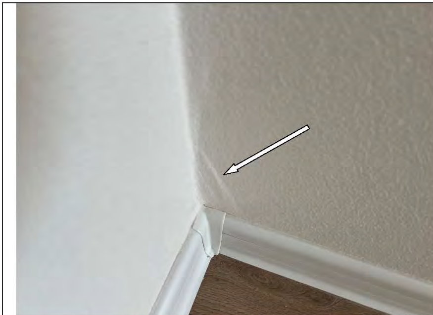
Фото №19. Отслоение обоевого полотна в коридоре.
