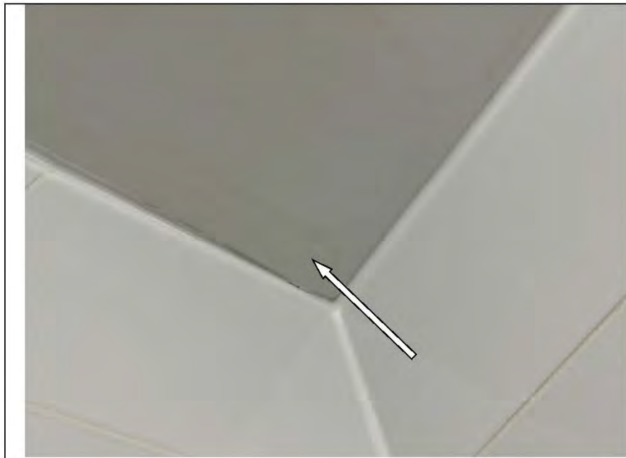
Фото №76. Загрязнение поверхности потолка в санузле.
