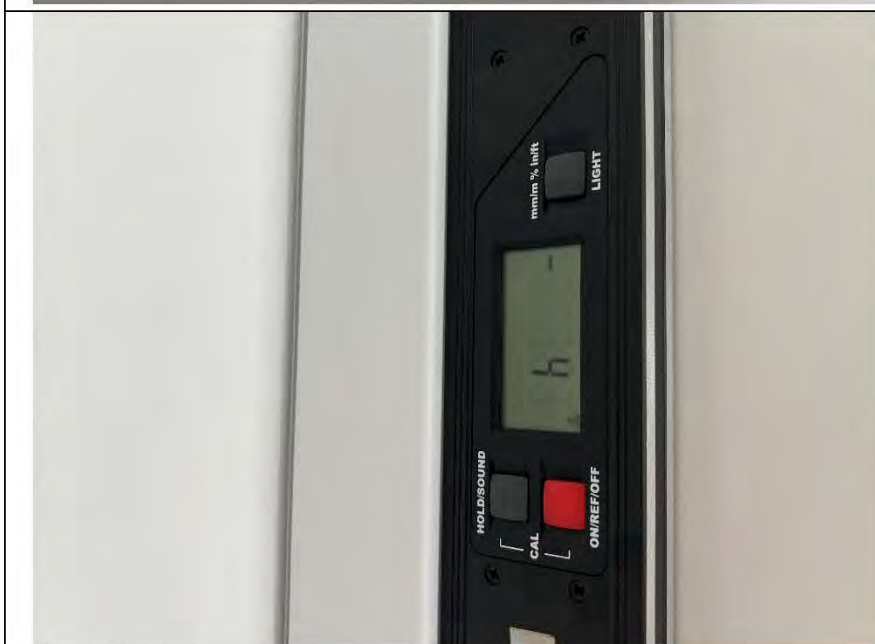
Фото №93. Отклонение коробки входного дверного блока по уровню вертикальности составляет 4 мм.
