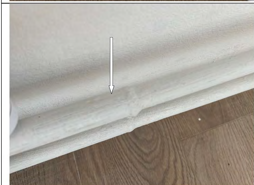
Фото №95. Подтеки краски на трубах отопления в гостиной.
