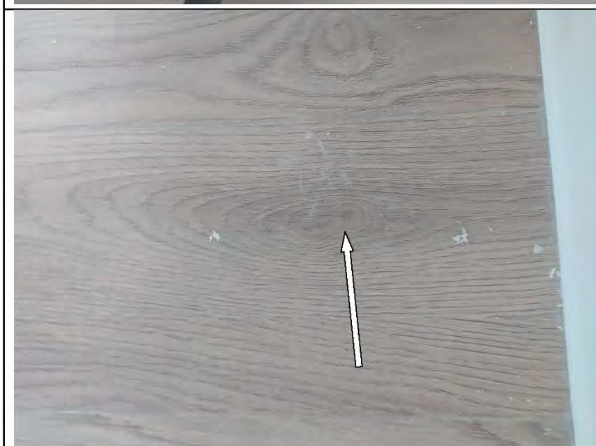
Фото №42. Загрязнения на поверхности ламината в кухне.
