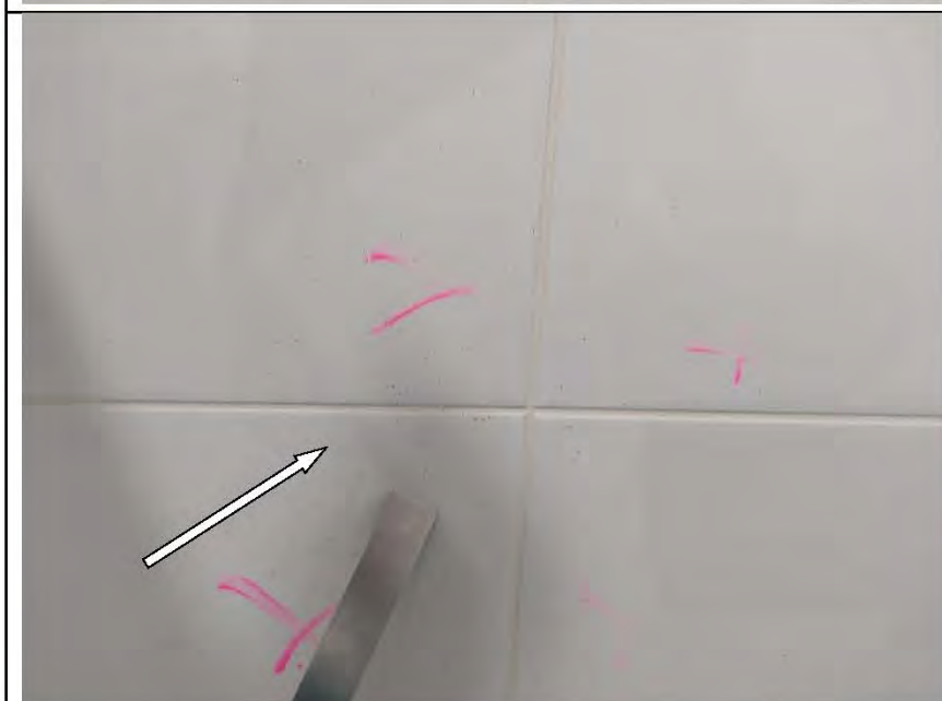
Фото №41. Многочисленные окалины на настенной керамической плитке в ванной комнате.
