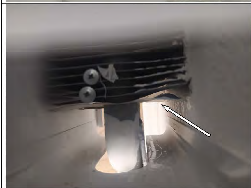
Фото №48. Радиатор в кухне имеет дефекты (заматия)
