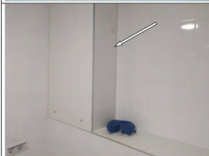
Фото №44. ПВХ панель в санузле имеет дефекты (загрязнение, пожелтения).
