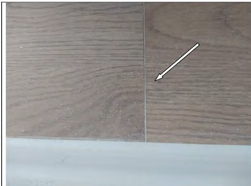
Фото №43. Загрязнения на поверхности ламината в спальне.
