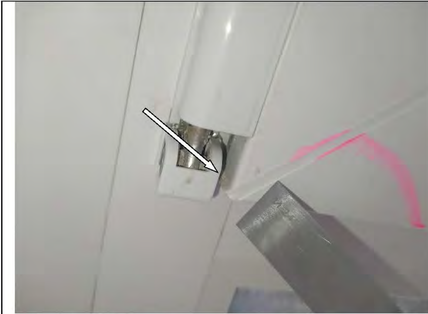
Фото №19. Профиль ПВХ оконного блока в кухне имеет дефекты (замятие).
