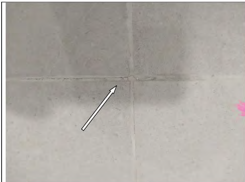
Фото №40. Затирка напольной плитки выполнена с нарушениями в ванной комнате: трещины.
