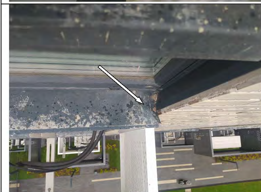
Фото №23. Металлический отлив оконного блока ПВХ в спальне имеет сильное замятие
