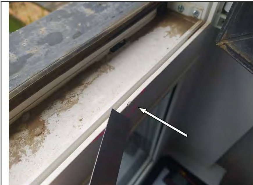
Фото №16. Профиль ПВХ оконного блока в спальне имеет дефекты (скол).
