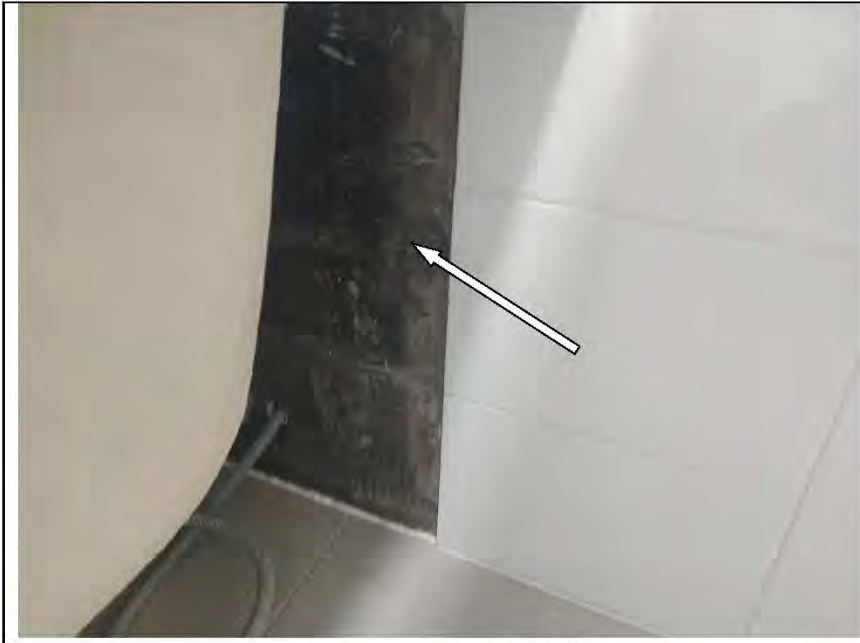
Фото №52. Частично отсутствует настенная керамическая плитка за ванной
