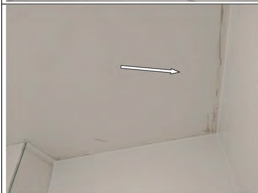
Фото №45. Потолочная ЛДСП панель в санузле имеет дефекты (загрязнение, пожелтения).
