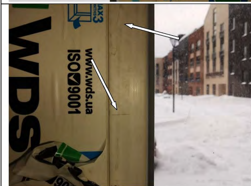
Фото №15. Царапины на профиле ПВХ оконного блока.
