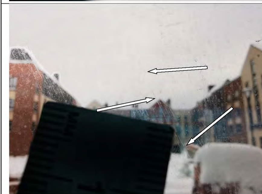
Фото №21. Царапины на стеклопакете ПВХ оконного блока.
