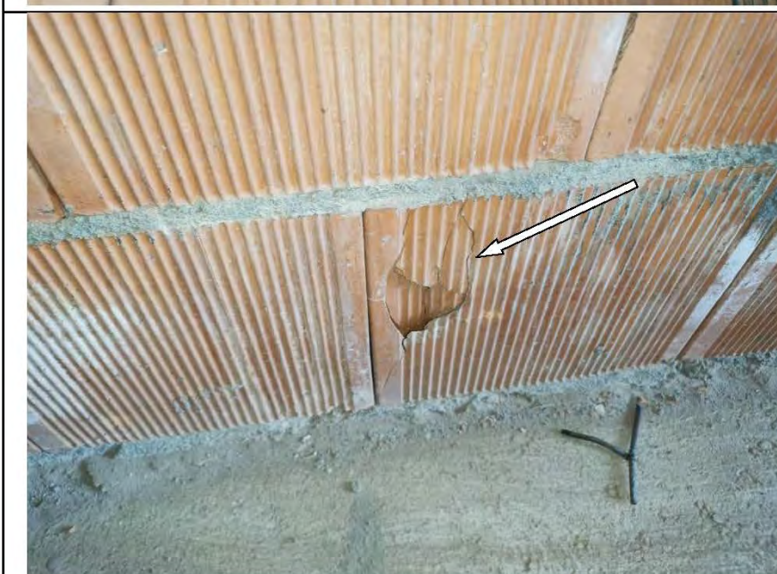
Фото №6. Разрушение конструкции кладки в квартире.
