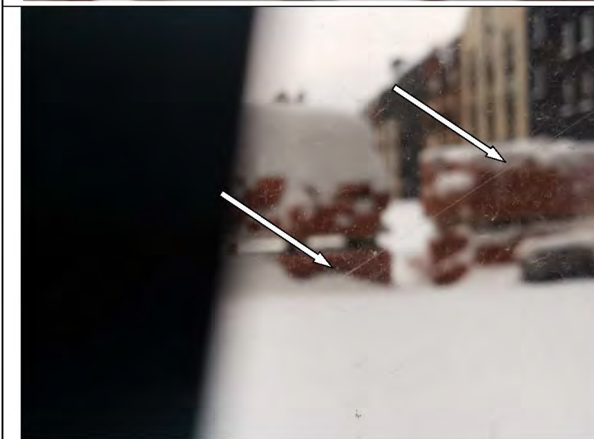
Фото №20. Царапины на стеклопакете ПВХ оконного блока.
