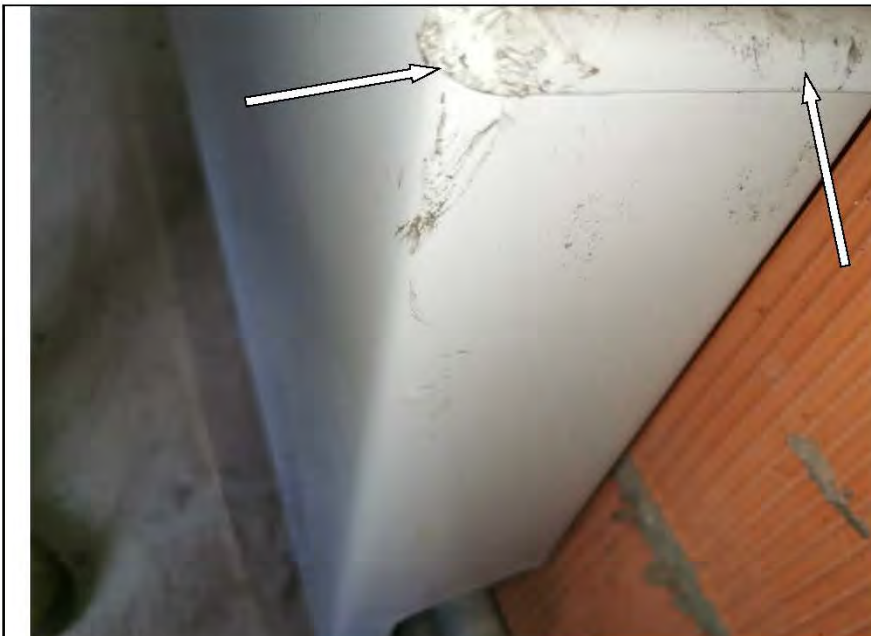
Фото №28. Загрязнения на кожухе отопительного прибора.
