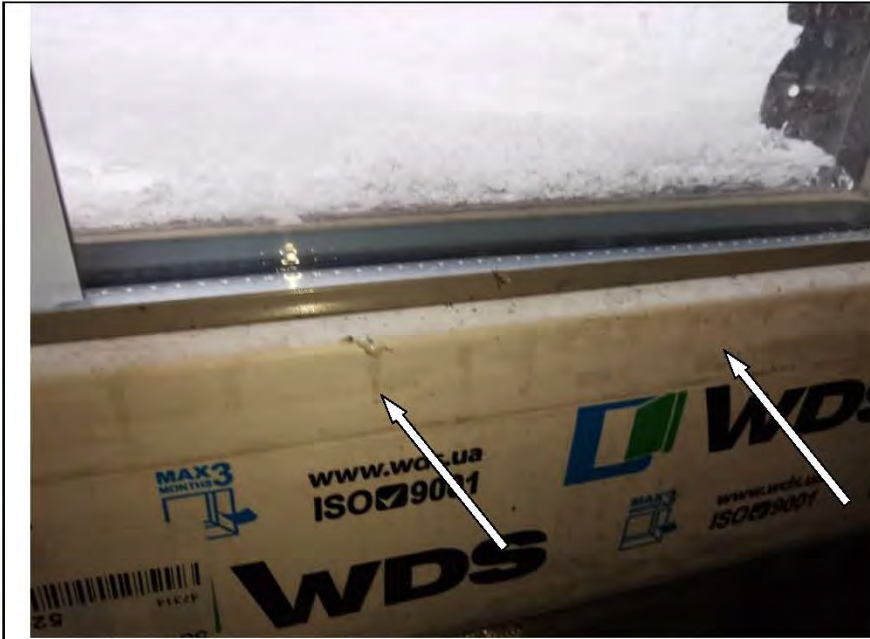
Фото №16. Загрязнения и потертости на профиле ПВХ оконного блока.
