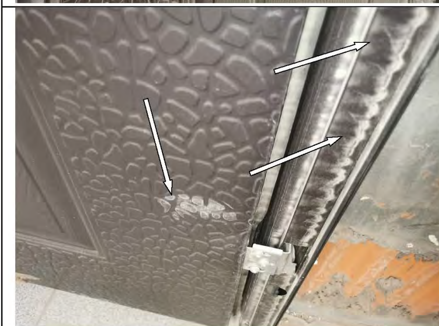
Фото №24. Загрязнения на коробе и полотне входного дверного блока.
