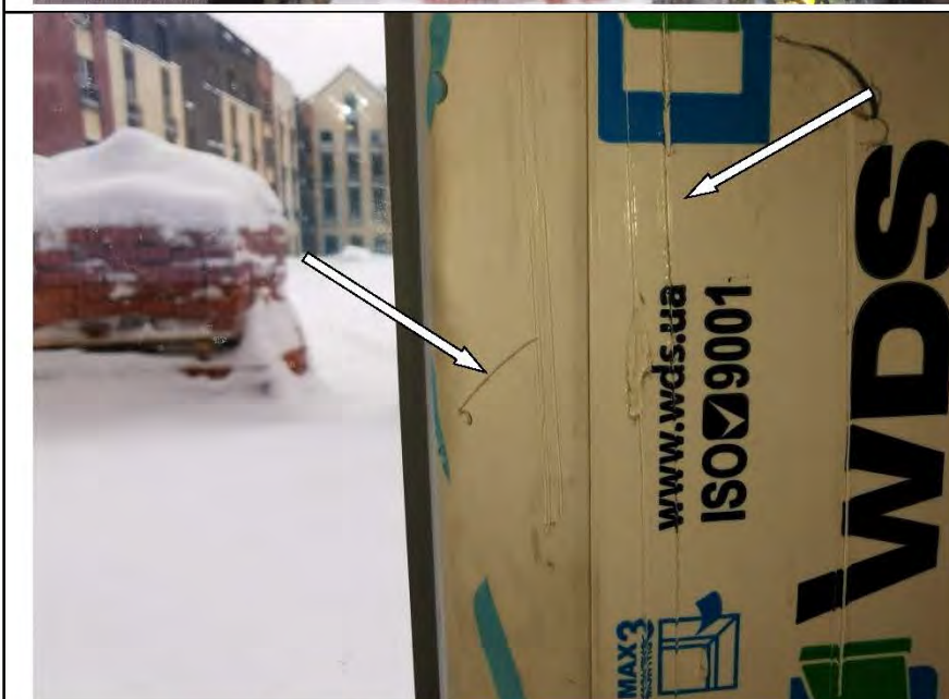
Фото №14. Царапины на профиле ПВХ оконного блока.
