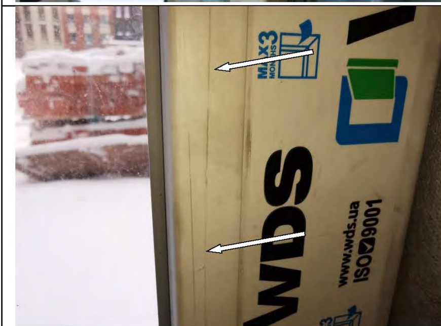
Фото №18. Царапины на профиле ПВХ оконного блока.
