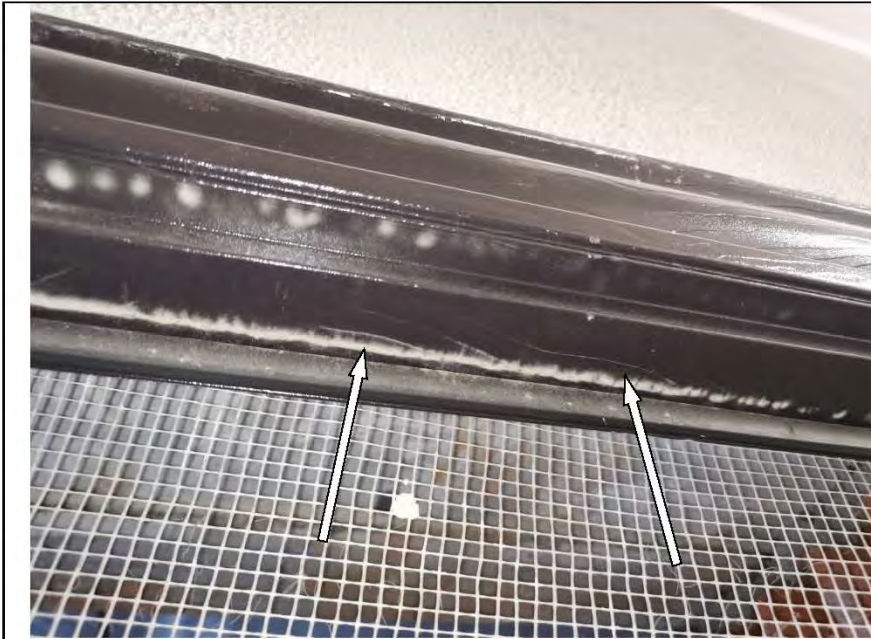
Фото №25. Царапины и загрязнения на коробе входного дверного блока.
