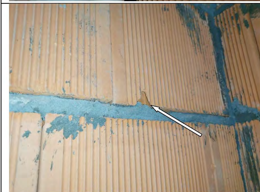
Фото №5. Разрушение конструкции кладки в квартире.
