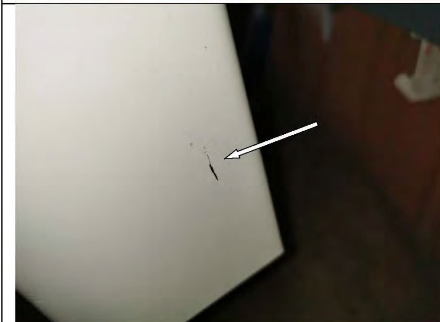
Фото №29. Царапины на кожухе отопительного прибора.
