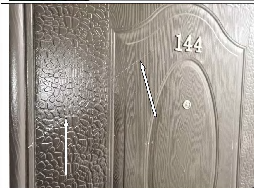
Фото №23. Загрязнения на полотне входного дверного блока.
