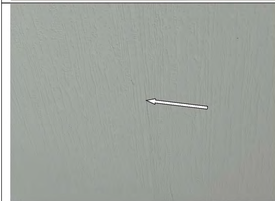
Фото №12. Читаемые обойные стыки на кухне.
