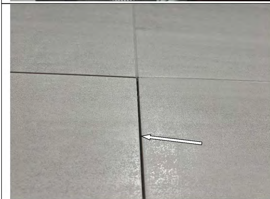
Фото №18. Пропуск затирочного раствора шовного пространства настенной керамической плитки в санузле.
