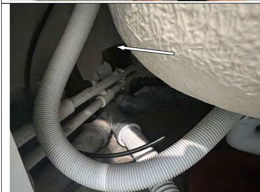
Фото №17. Отсутствует плитка за ванной.
