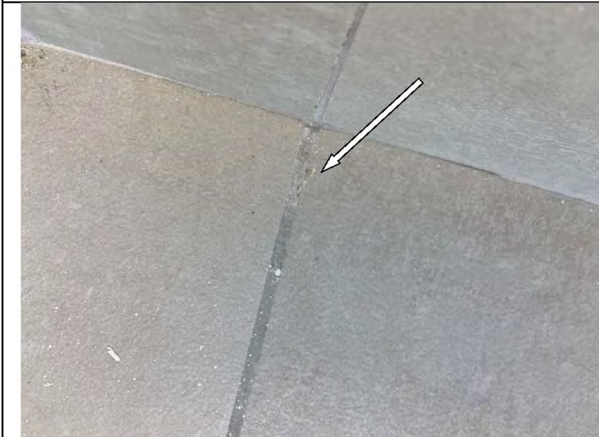
Фото №26. Неровные швы напольной керамической плитки на лоджии.
