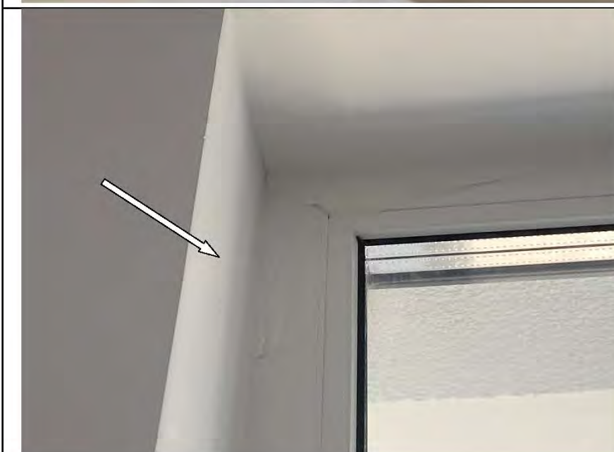
Фото №42. Неровности, выбоины, раковины на окрашенных откосах оконного блока ПВХ в кухне.
