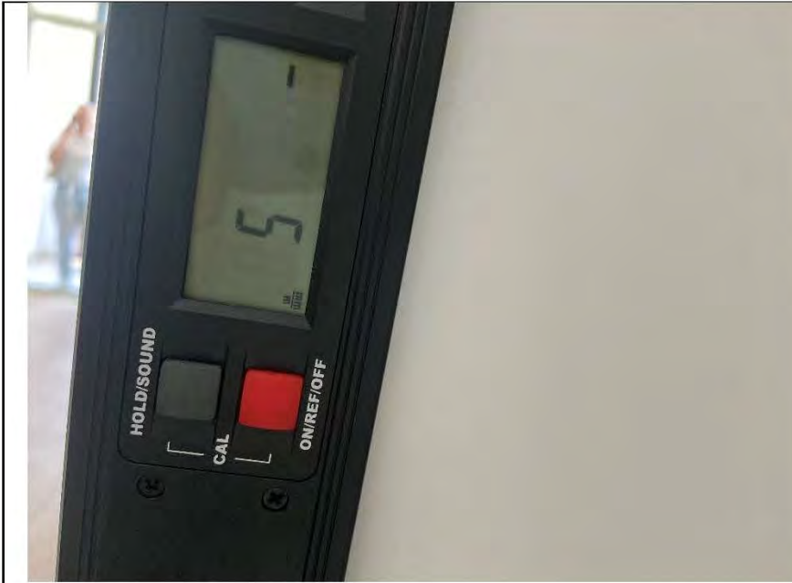
Фото №10. Отклонения поверхности стен от вертикали в кухне.
