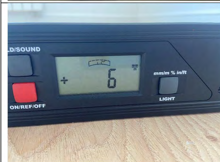
Фото №14. Отклонения поверхности напольного покрытия из ламината в спальне.
