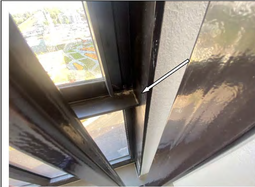
Фото №46. Дефект на металлическом профиле оконного блока на лоджии.
