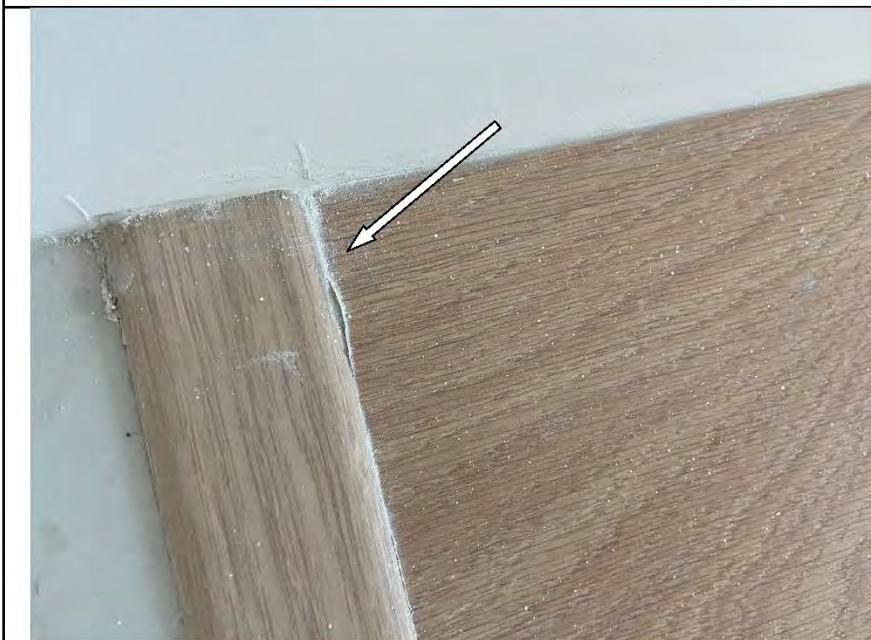
Фото №32. Дефект на поверхности напольного покрытия из ламината в кухне.
