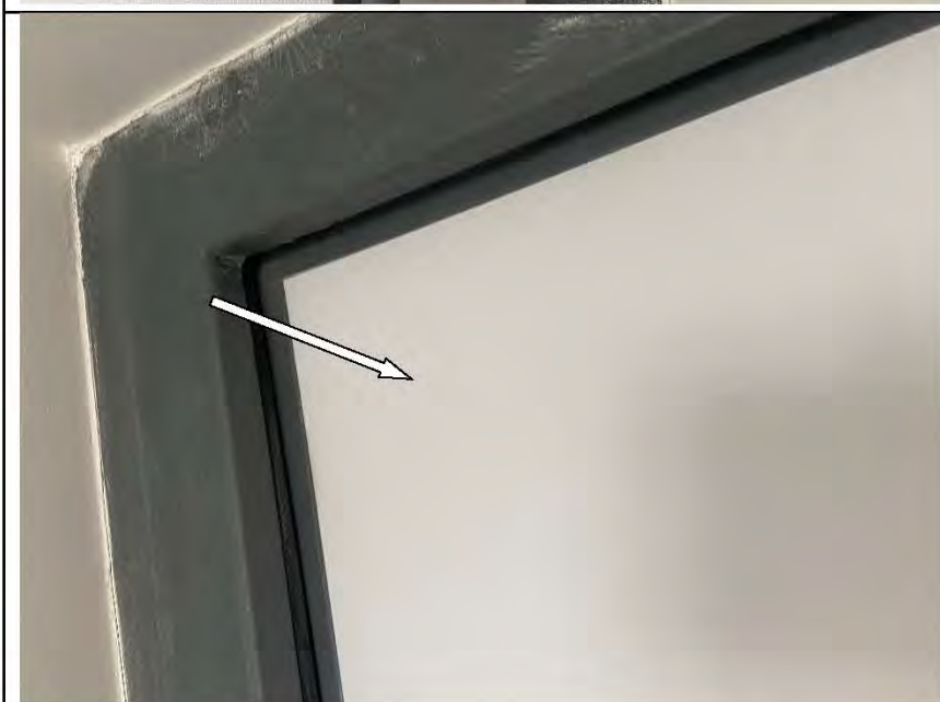
Фото №50. Дефект на полотне входного дверного блока в коридоре.
