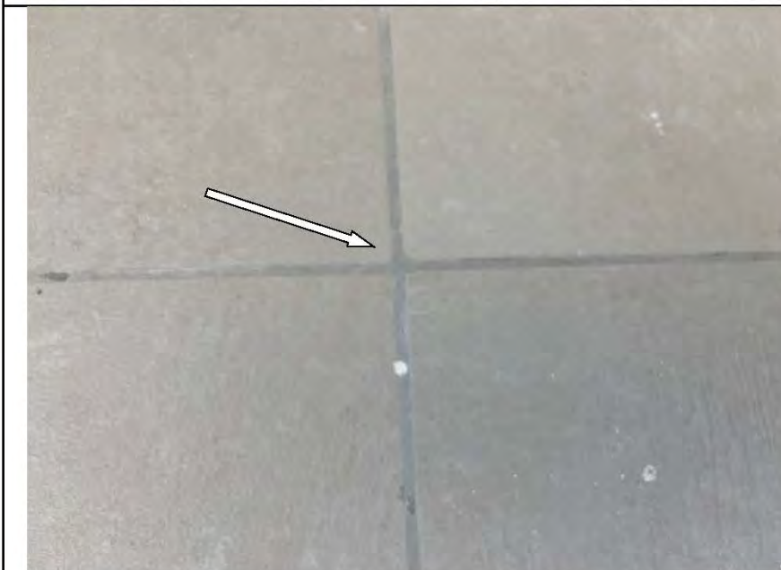
Фото №27. Неровные швы напольной керамической плитки в кухне.
