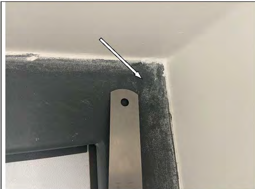
Фото №49. Дефект на коробке входного дверного блока в коридоре.
