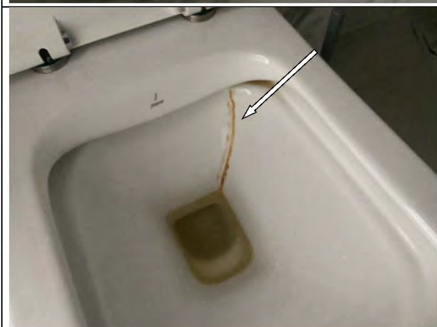
Фото №72. Постоянная протечка на унитазе в ванной комнате.
