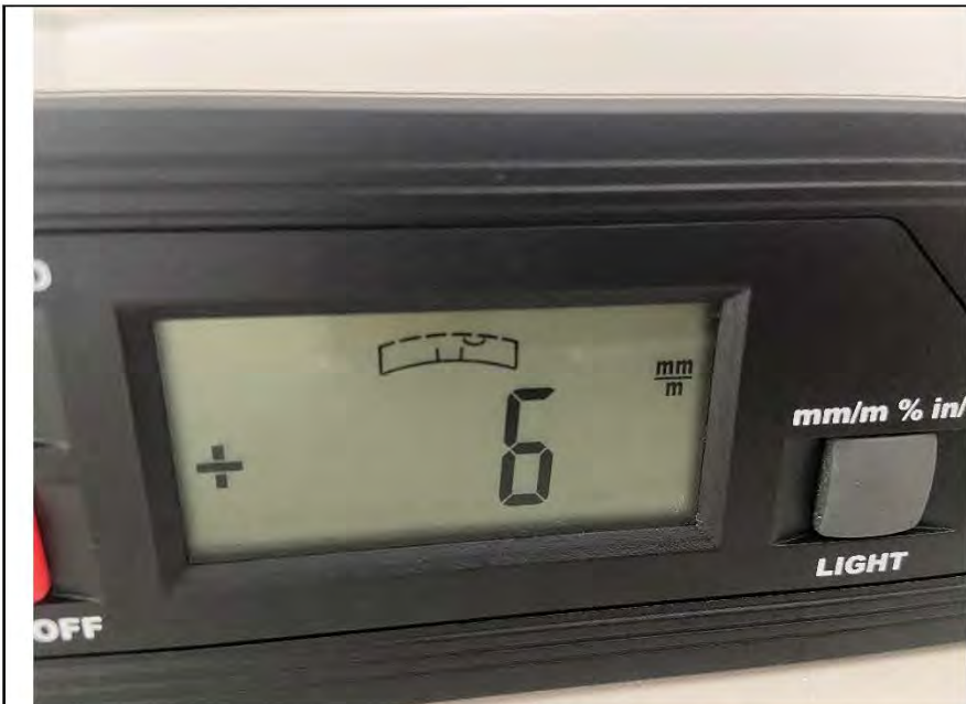
Фото №16. Отклонения поверхности напольного покрытия из керамической плитки в коридоре.
