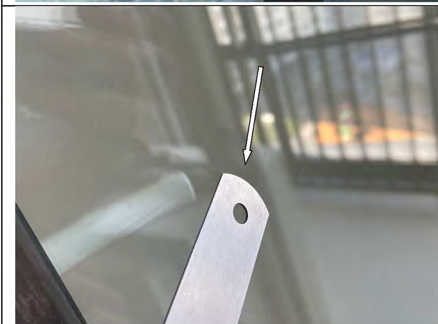
Фото №39. Царапина на стеклопакете конного блока ПВХ в кухне.
