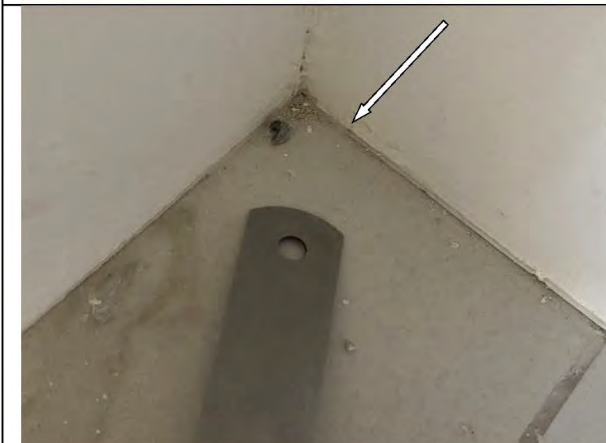
Фото №20. Загрязнения на напольной керамической плитке в коридоре.
