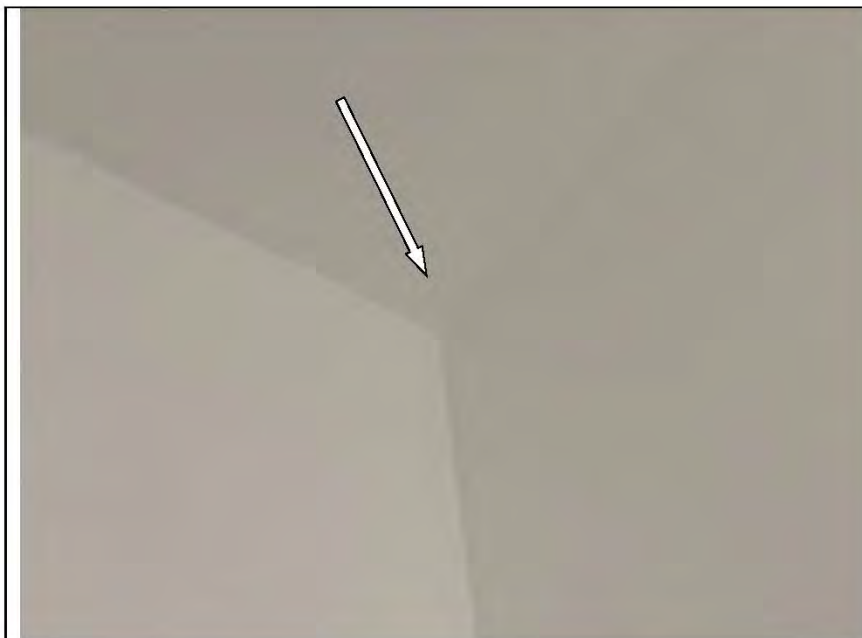
Фото №64. Дефект на поверхности подвесного потолка в коридоре.
