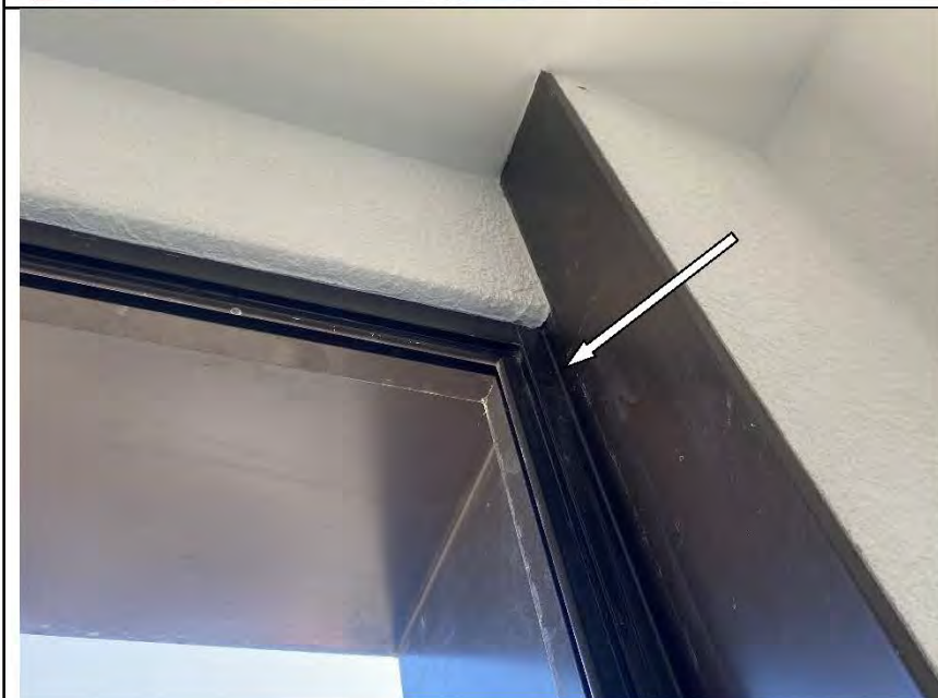
Фото №47. Дефект на металлическом профиле оконного блока на лоджии.
