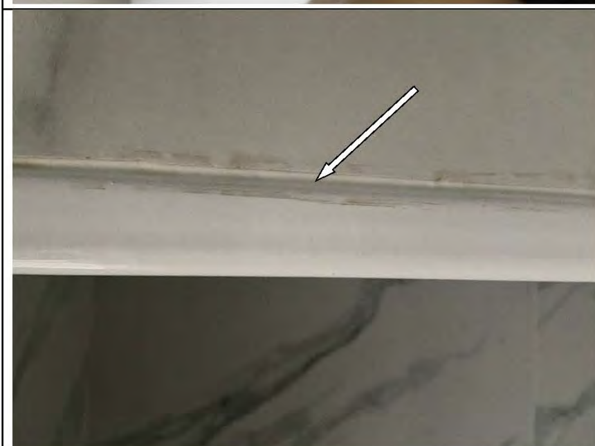
Фото №71. Дефект на ванне в ванной комнате.
