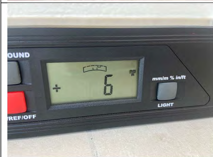
Фото №18. Отклонения поверхности напольного покрытия из керамической плитки на лоджии.
