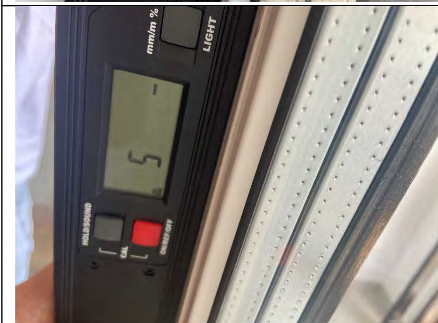
Фото №44. Отклонения от вертикали оконного блока ПВХ в кухне.
