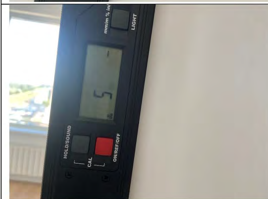
Фото №9. Отклонения поверхности стен от вертикали в спальне.
