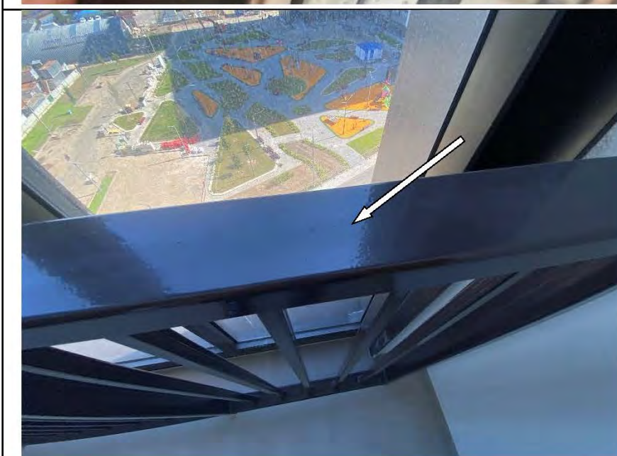
Фото №45. Дефект на металлическом ограждении на лоджии.
