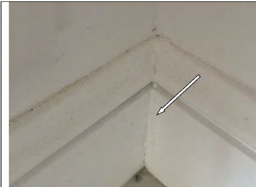
Фото №28. Дефект на напольном деревянном плинтусе в коридоре.
