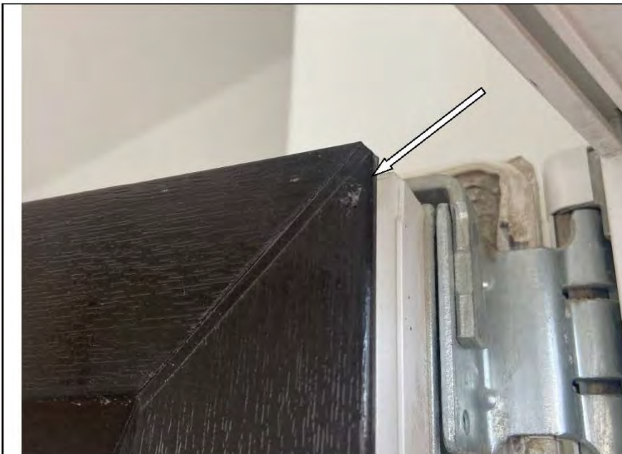
Фото №37. Дефект на профиле оконного блока ПВХ в кухне.
