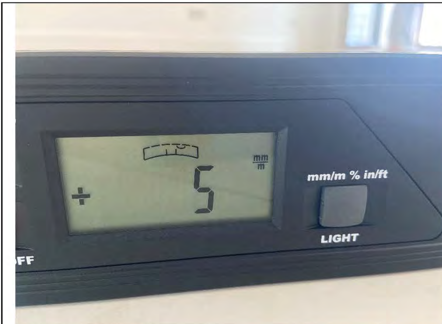
Фото №19. Отклонения поверхности напольного покрытия из керамической плитки в кухне.
