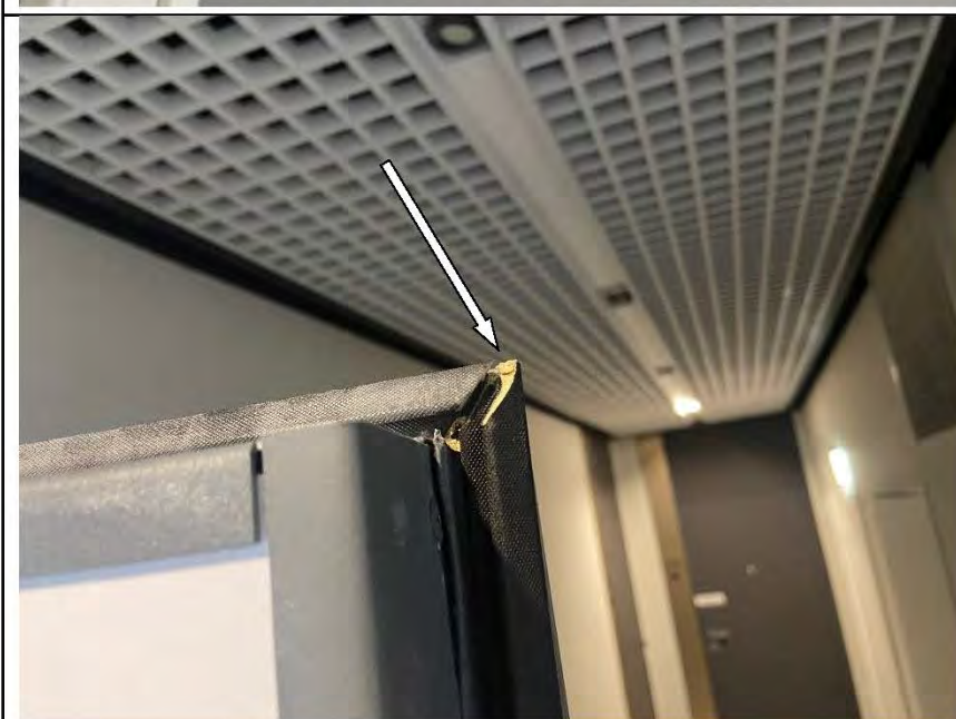
Фото №60. Дефект на уплотнительной противопожарной ленте входного дверного блока в коридоре.
