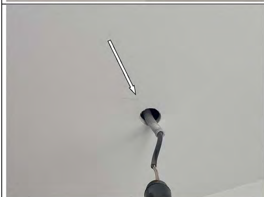
Фото №65. Дефект на поверхности подвесного потолка в спальне.
