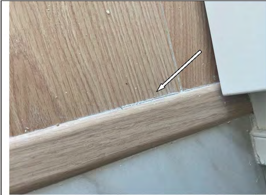
Фото №31. Дефект на поверхности напольного покрытия из ламината в спальне.
