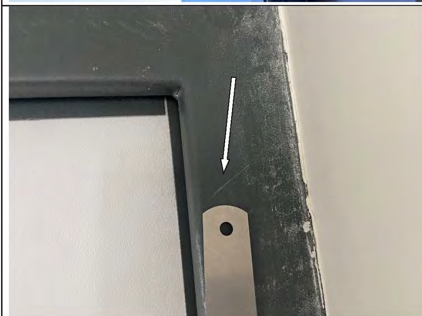
Фото №48. Дефект на коробке входного дверного блока в коридоре.
