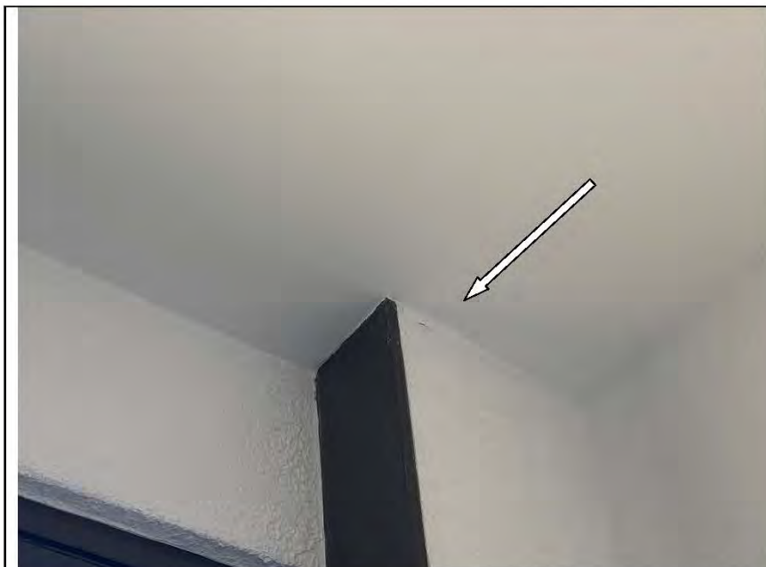
Фото №67. Дефект на поверхности подвесного потолка на лоджии.
