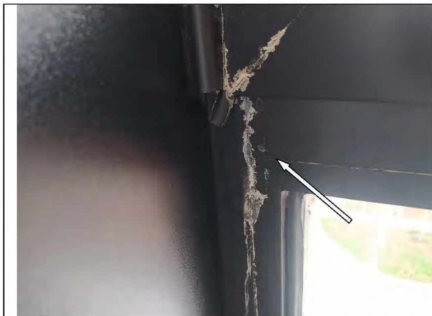
Фото №1. Следы протечек на металлическом профиле оконного блока №1.
