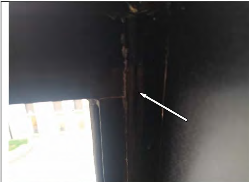
Фото №4. Следы протечек на металлическом профиле оконного блока №3.
