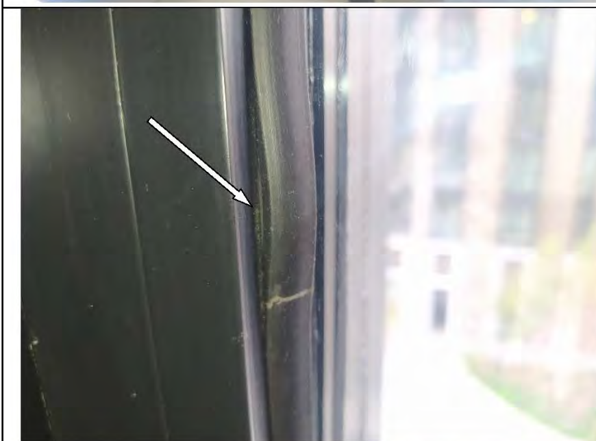
Фото №8. Дефект установки части уплотняющей прокладки на оконном блоке №2
