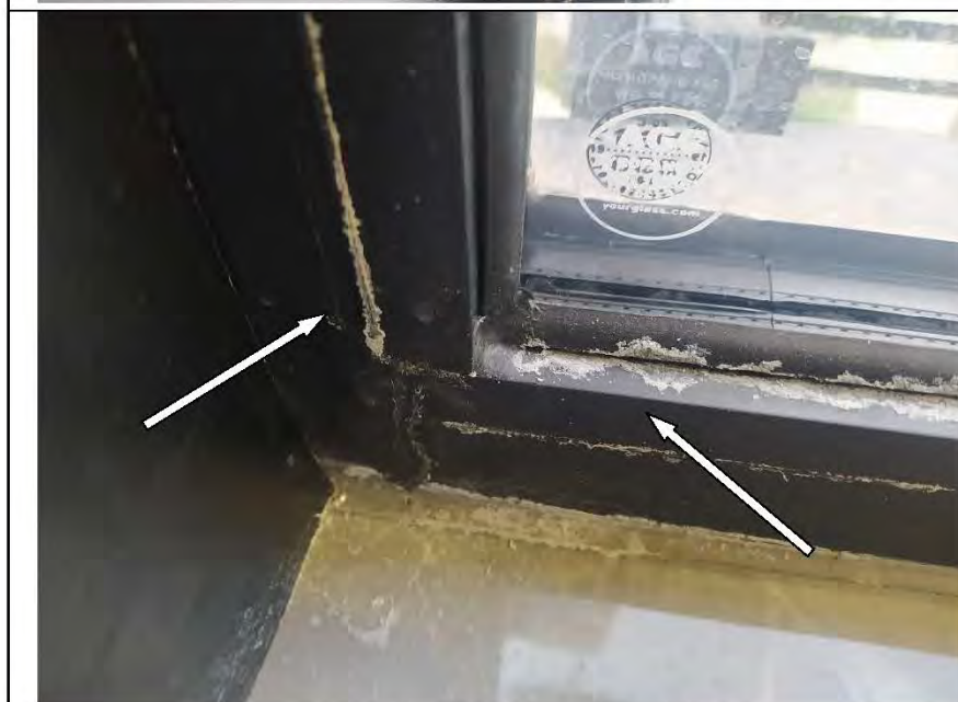
Фото №2. Следы протечек на металлическом профиле оконного блока №1.
