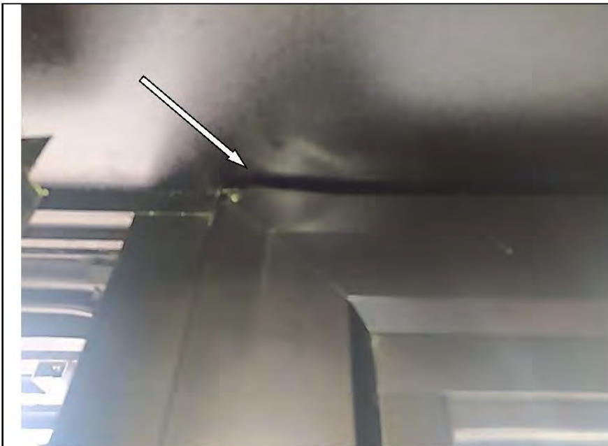
Фото №7. Дефект на металлическом профиле оконного блока №3 (сильное замятие).
