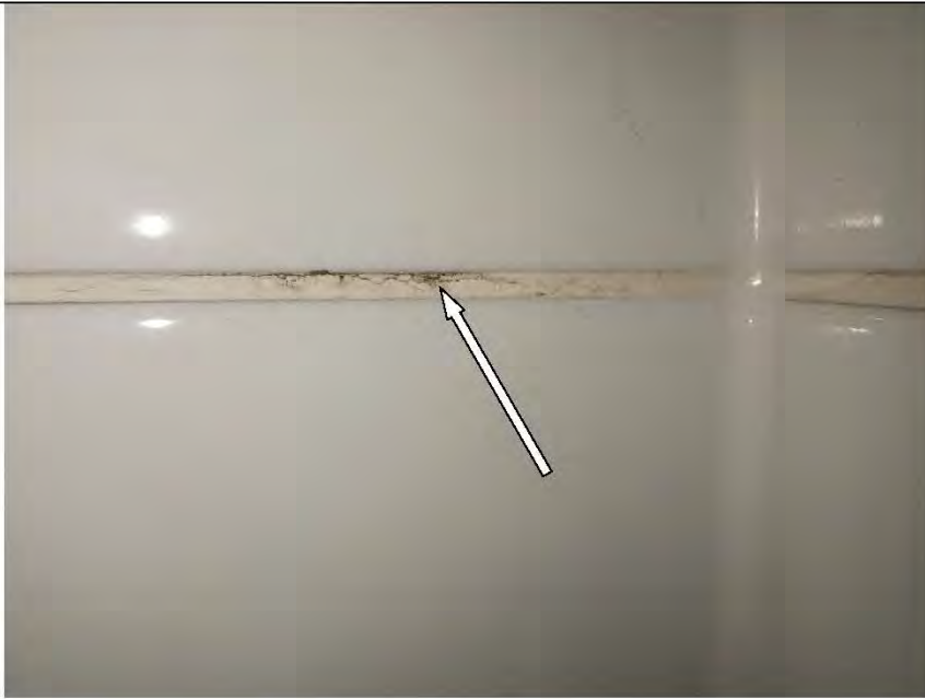
Фото №25. Трещина затирочного раствора в шовном пространстве настенной керамической плитки в ванной комнате.
