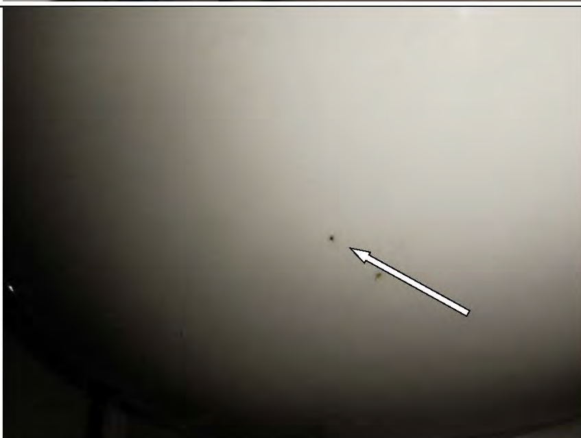
Фото №78. Окалины на унитазе в ванной комнате.
