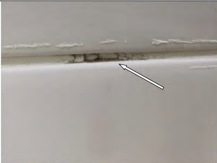
Фото №26. Трещина затирочного раствора в шовном пространстве настенной керамической плитки в санузле.
