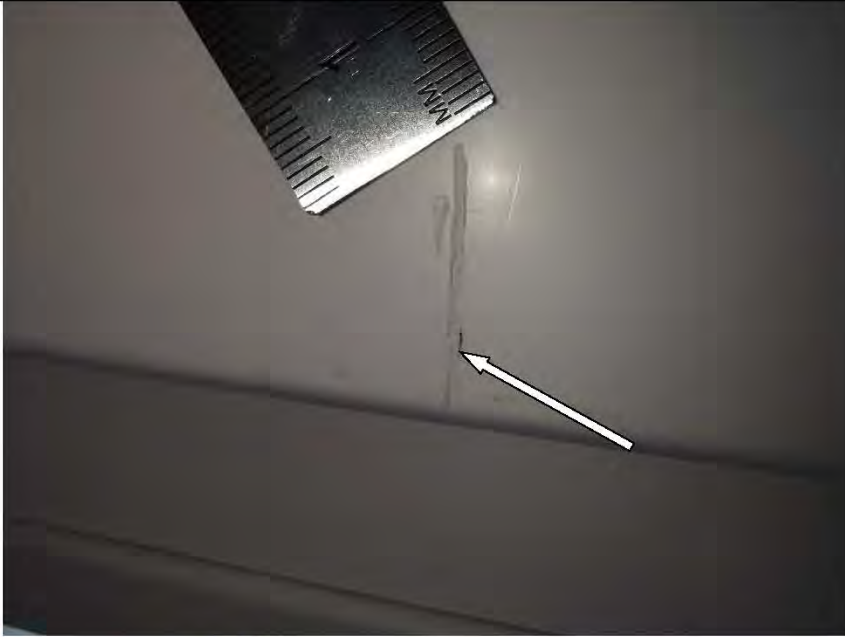
Фото №52. Царапины на лицевой поверхности профиля ПВХ оконного блока в спальне.
