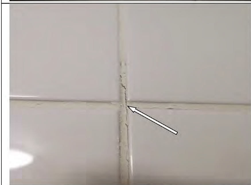
Фото №24. Трещина затирочного раствора в шовном пространстве настенной керамической плитки в ванной комнате.
