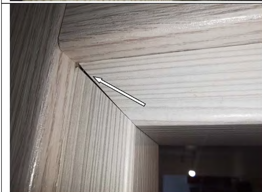
Фото №74. Элементы дверного блока соединены не надежно в ванной комнате.
