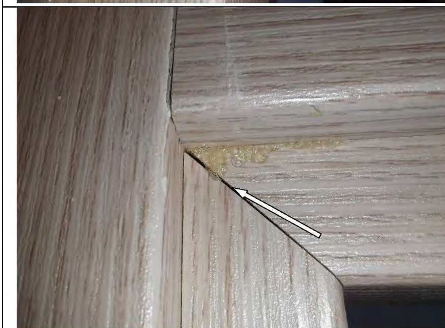
Фото №75. Элементы дверного блока соединены не надежно в спальне.
