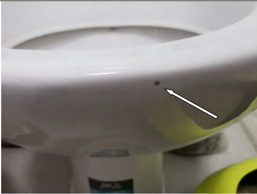
Фото №79. Скол на унитазе в санузле.
