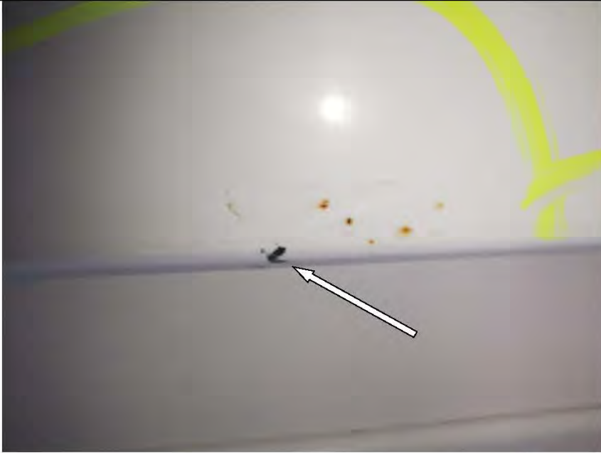
Фото №58. Сколы на профиле ПВХ оконного блока в гостиной.
