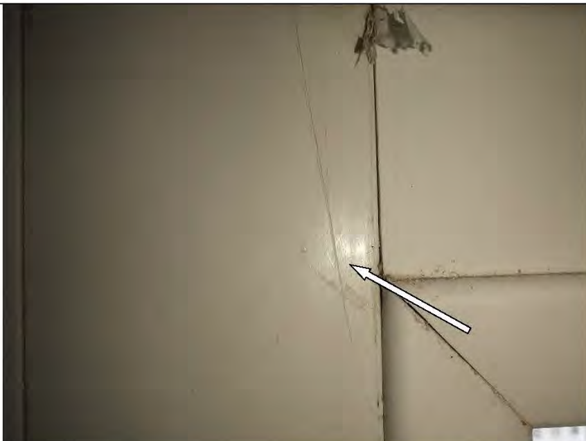
Фото №55. Царапины на лицевой поверхности профиля ПВХ оконного блока в гостиной.
