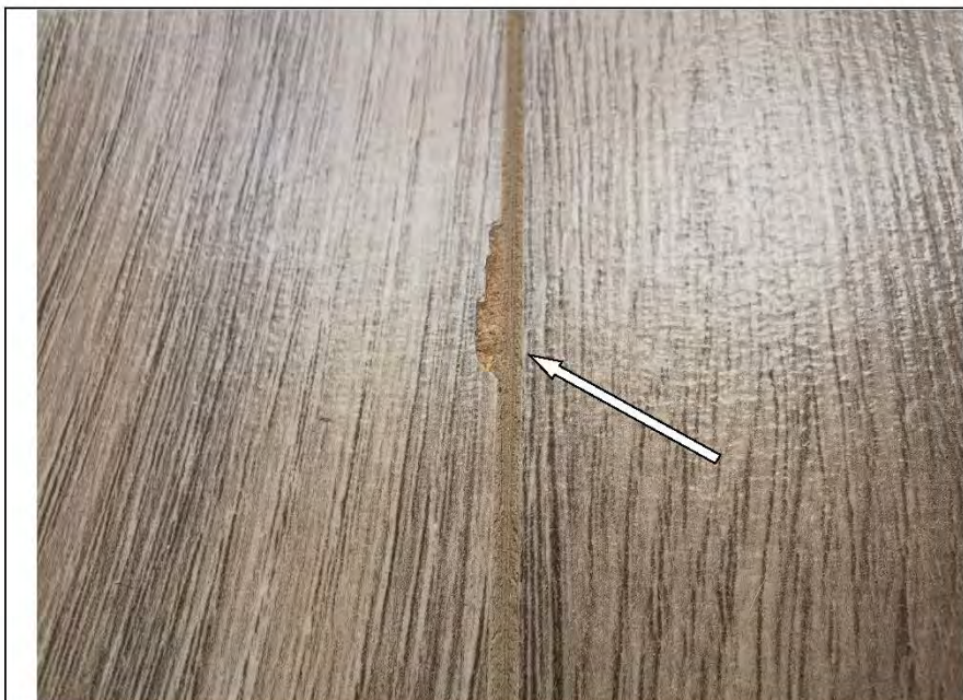
Фото №37. Отслоение ламинации на лицевой поверхности напольного покрытия из ламината в кухне.
