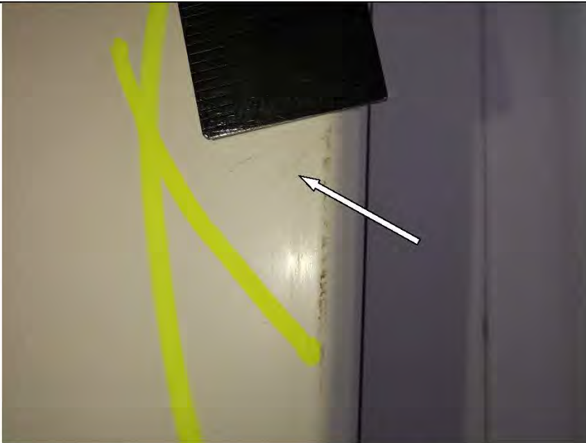
Фото №53. Царапины на лицевой поверхности профиля ПВХ оконного блока в спальне.
