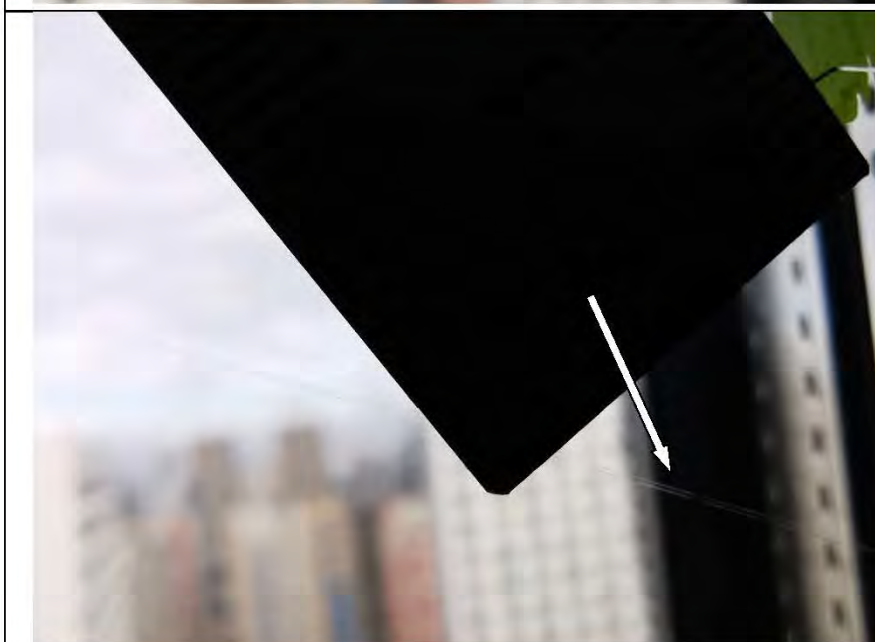
Фото №50. Царапина на стеклопакете оконного блока ПВХ в гостиной.
