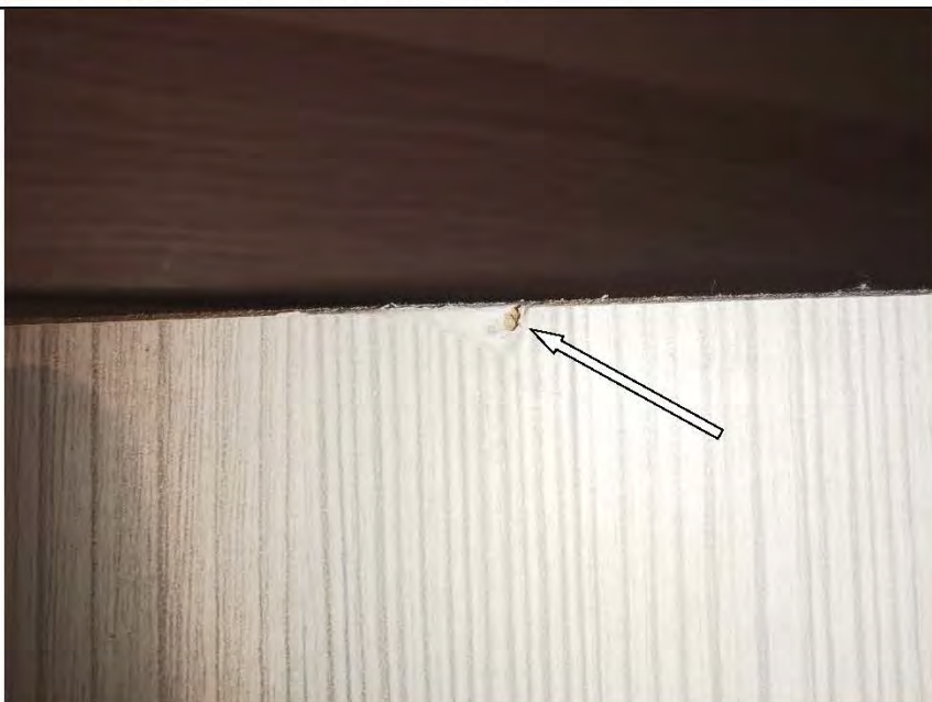
Фото №71. Скол на полотне деревянного дверного блока в ванной комнате.
