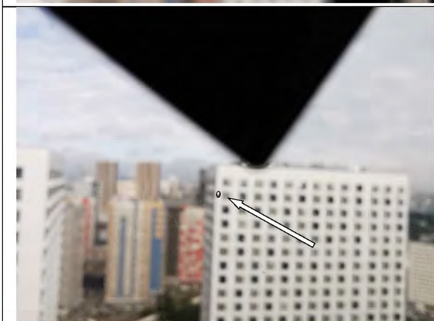
Фото №51. Окарины на стеклопакете оконного блока ПВХ в гостиной.
