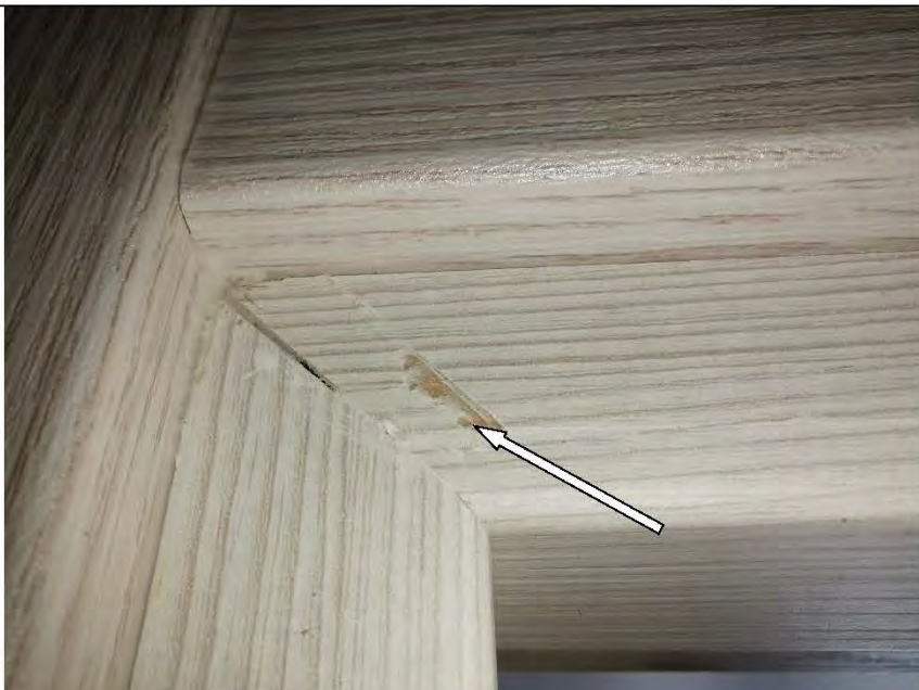
Фото №70. Скол на коробе деревянного дверного блока в гостиной.
