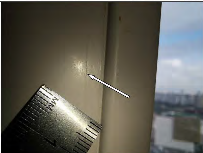
Фото №56. Царапины на лицевой поверхности профиля ПВХ оконного блока в кухне.
