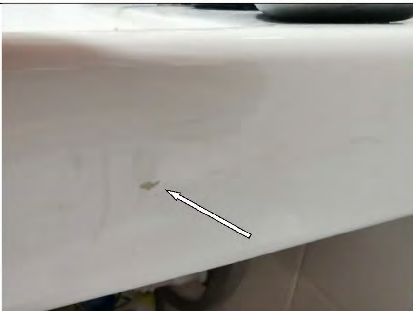
Фото №77. Скол на раковине в ванной комнате.
