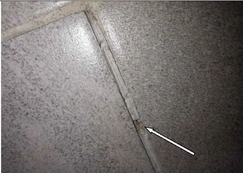
Фото №34. Трещина затирочного раствора в шовном пространстве напольной керамической плитки в ванной комнате.
