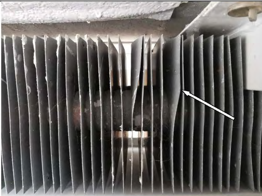
Фото №80. Замятие сот радиатора в спальне.
