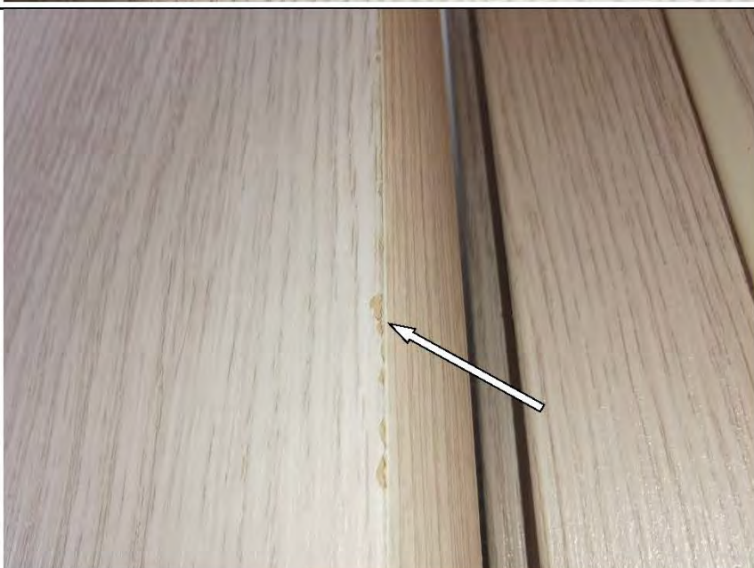
Фото №72. Скол на полотне деревянного дверного блока в спальне.
