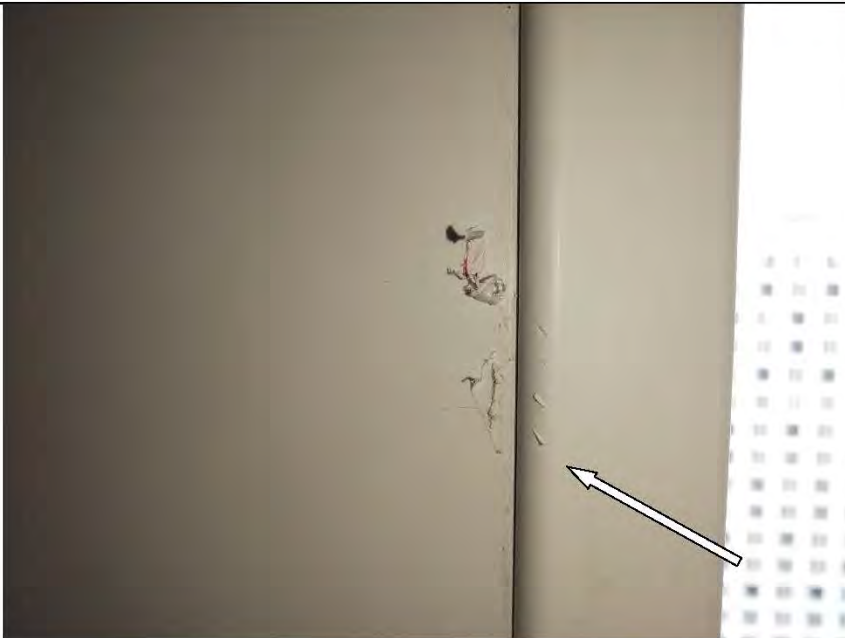
Фото №59. Сколы на профиле ПВХ оконного блока в гостиной.
