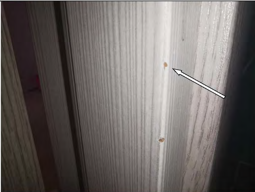
Фото №68. Скол на коробе деревянного дверного блока в ванной комнате.
