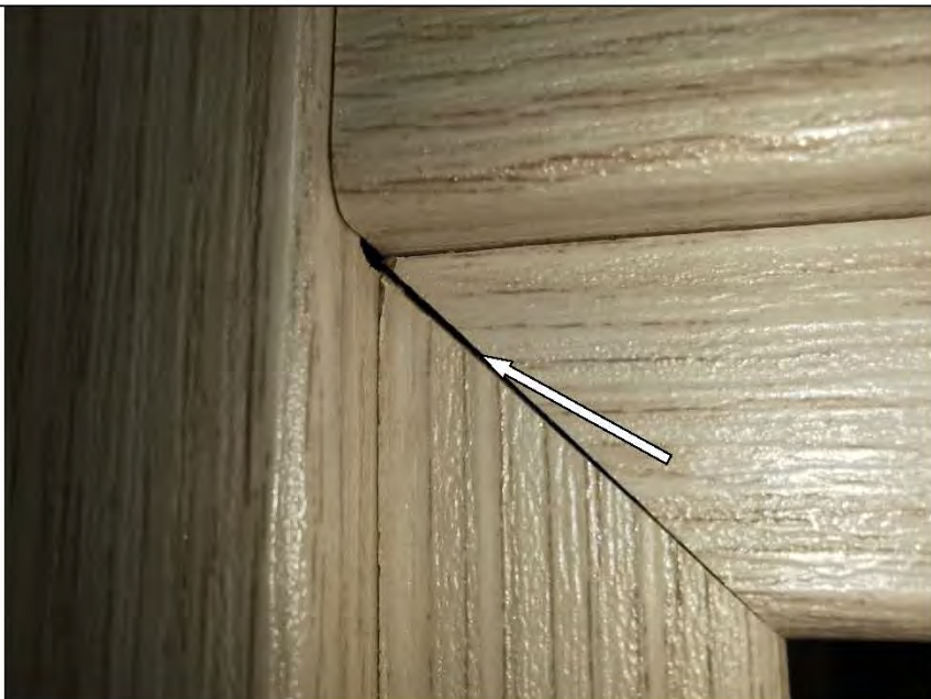
Фото №76. Элементы дверного блока соединены не надежно в санузле.
