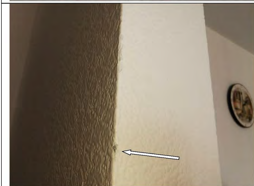
Фото №20. Отслоение краски на поверхности обойного полотна в спальне.
