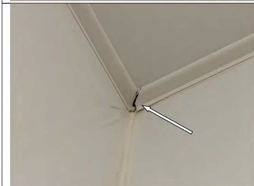
Фото №65. Зазор в стыке монтажа декоративного молдинга крепления натяжного потолка в ванной комнате.
