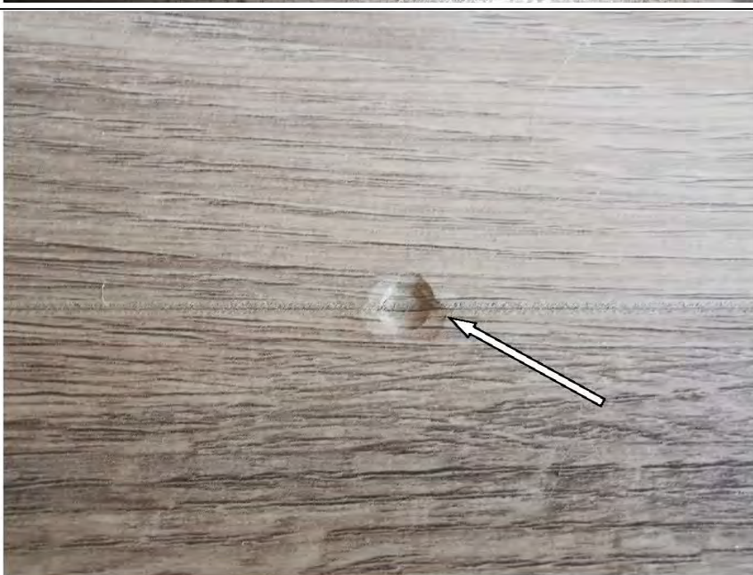
Фото №36. Вмятина на лицевой поверхности напольного покрытия в кухне.
