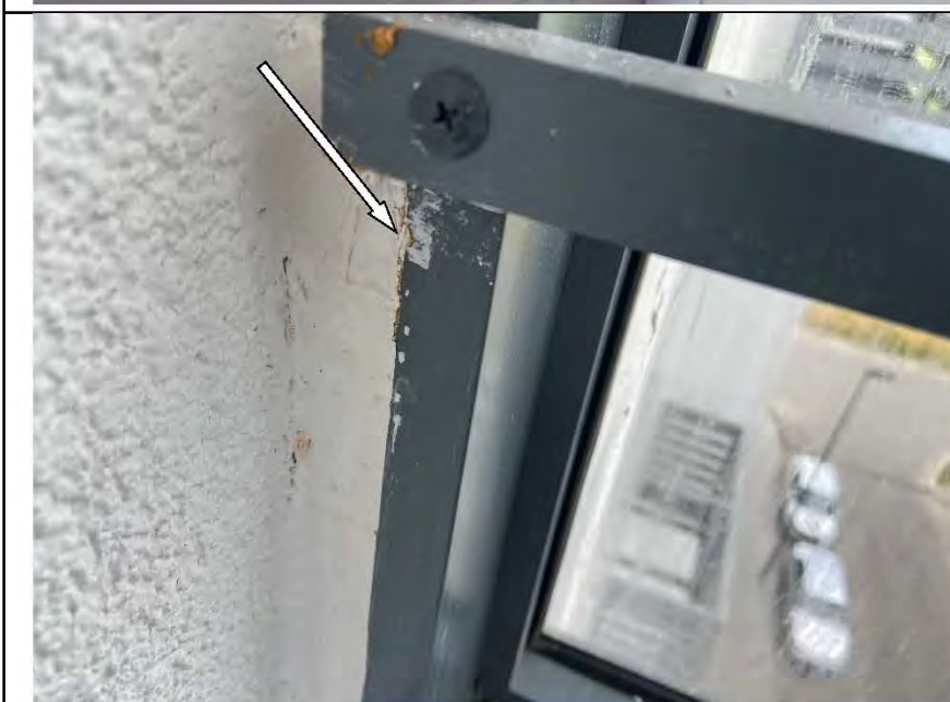
Фото №42. Дефект на алюминиевом профиле оконного блока на лоджии.
