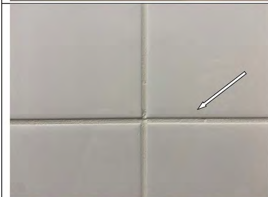
Фото №14. Неровные швы настенной керамической плитки в ванной комнате.
