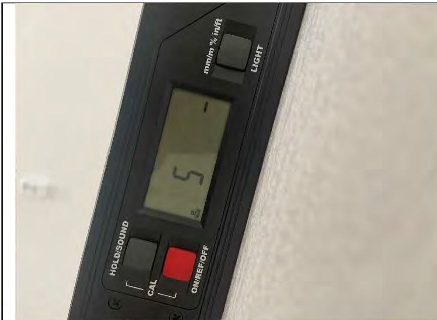
Фото №10. Отклонение поверхности стен от вертикали в спальне.
