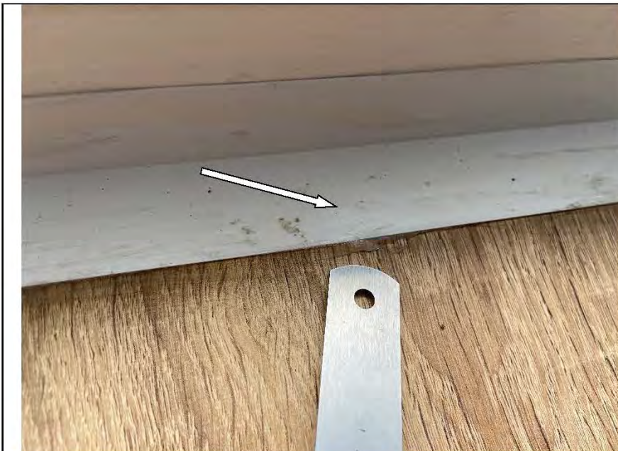
Фото №34. Загрязнения на напольном металлическом порошке в кухне.
