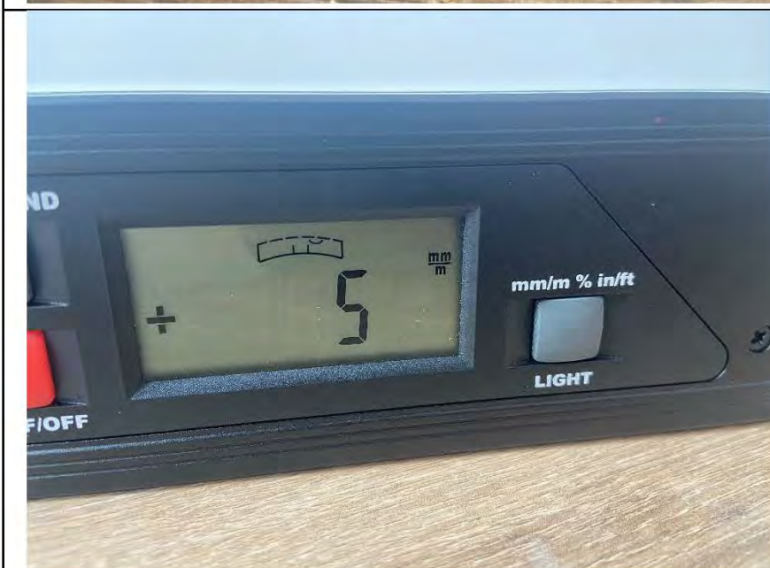
Фото №17. Отклонение напольного покрытия из ламината в коридоре.
