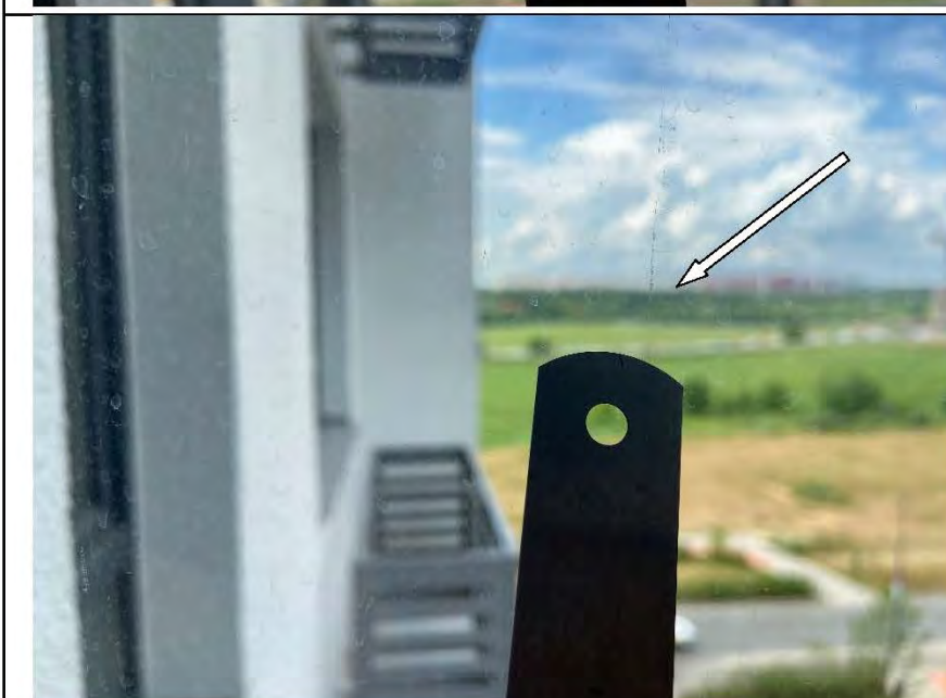
Фото №45. Царапина на стеклопакете алюминиевого оконного блока на лоджии.
