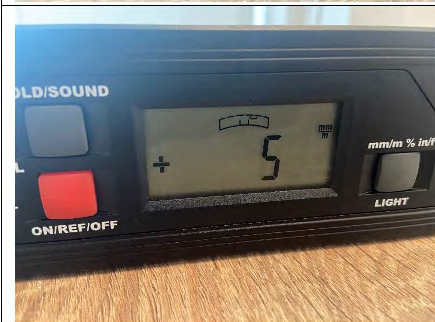
Фото №18. Отклонение напольного покрытия из ламината в кухне.
