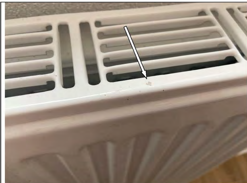
Фото №76. Загрязнения на металлическом кожухе отопительного прибора в кухне.
