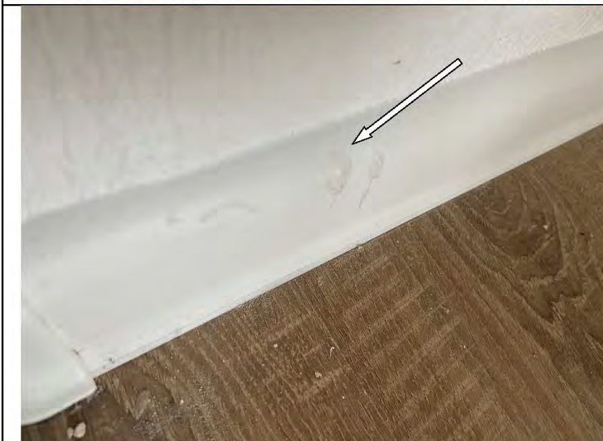
Фото №26. Загрязнения на напольном плинтусе ПВХ в коридоре.
