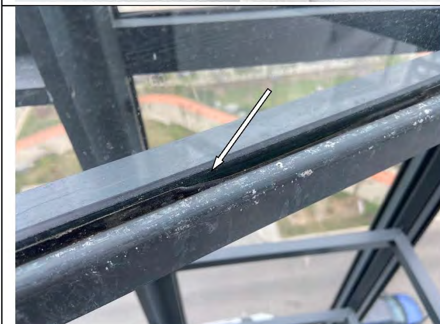
Фото №38. Дефект на уплотнительной ленте алюминиевого оконного блока на лоджии.
