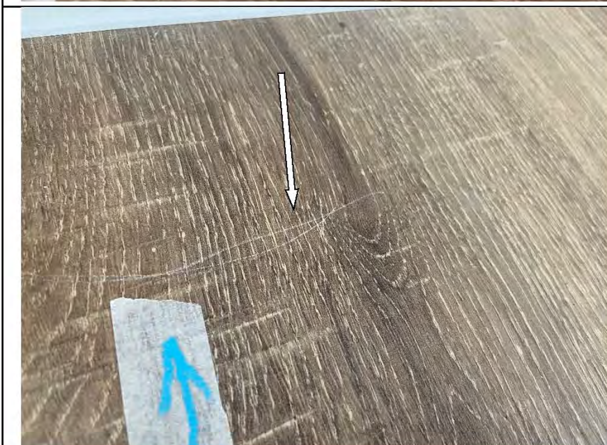
Фото №33. Дефект на напольном покрытии из ламината в спальне.
