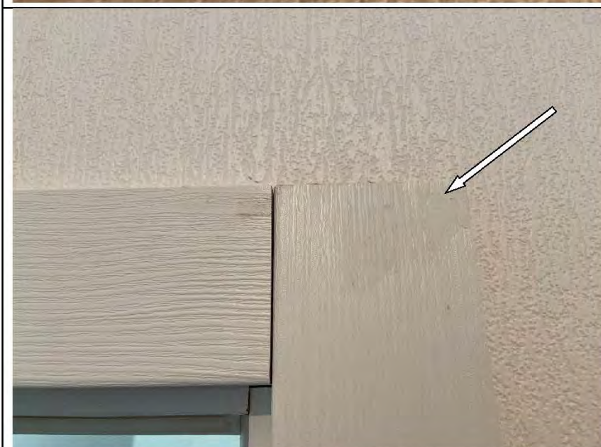
Фото №62. Дефект на наличниках деревянного дверного блока в ванной комнате.
