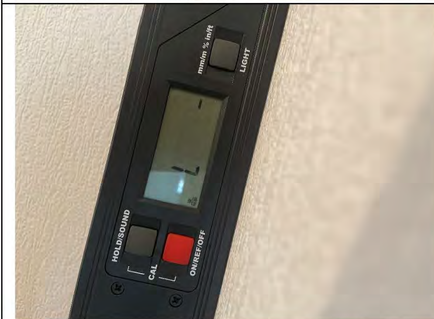
Фото №8. Отклонение поверхности стен от вертикали в кухне.
