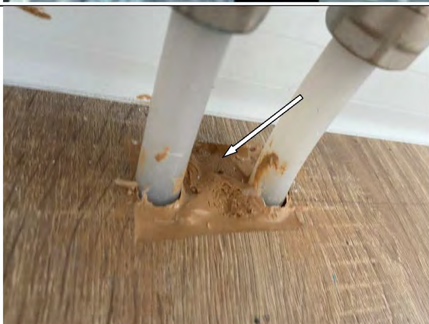
Фото №48. Дефект вставки труб отопления в напольное покрытие из ламината в кухне.
