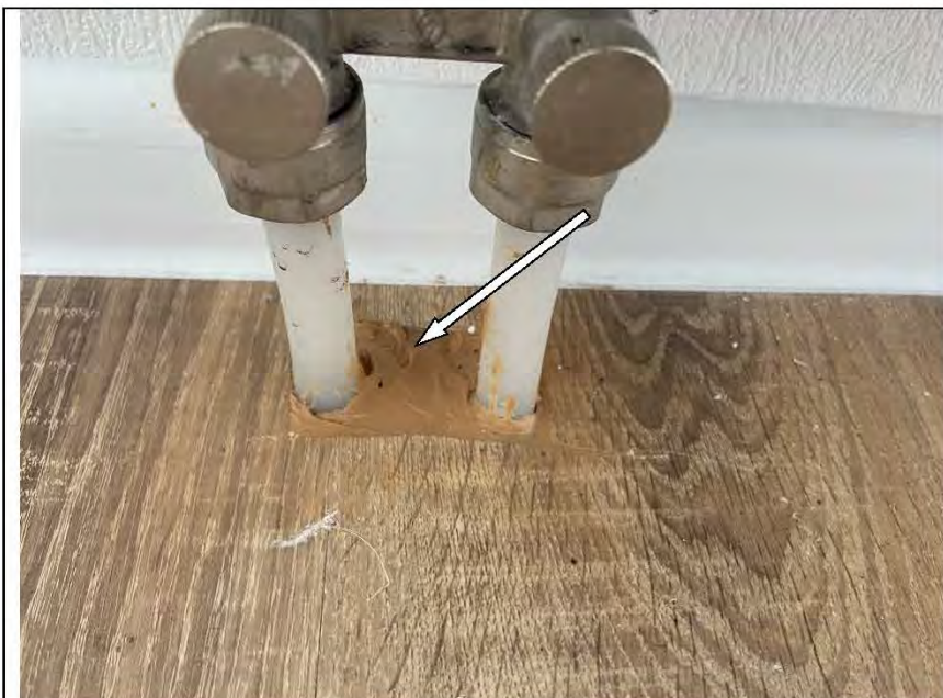
Фото №49. Дефект вставки труб отопления в напольное покрытие из ламината в кухне.
