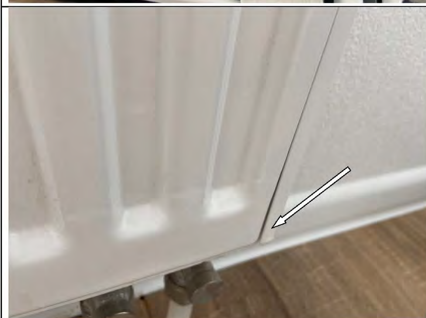
Фото №78. Загиб на металлическом кожухе отопительного прибора в спальне.
