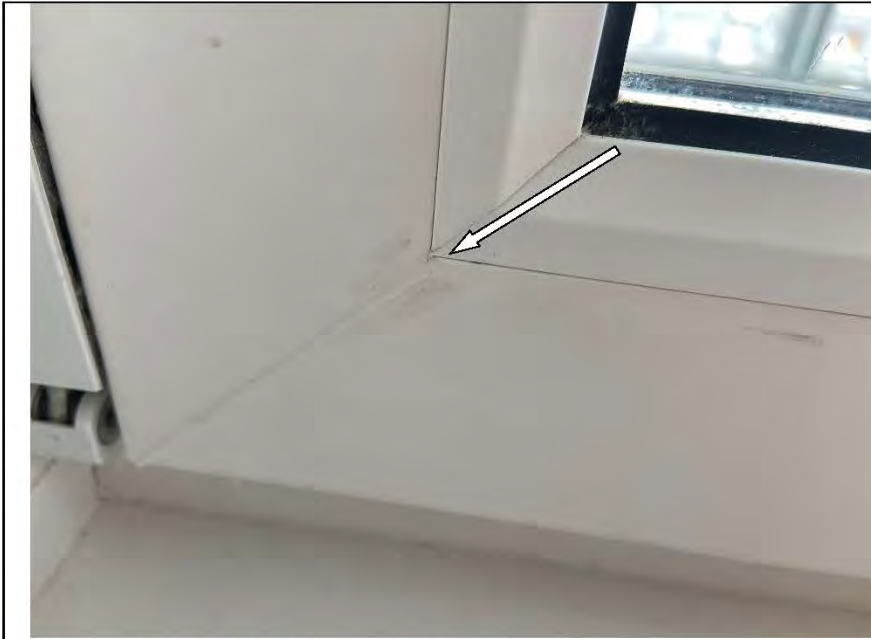
Фото №40. Загрязнения на профиле оконного блока ПВХ в кухне.
