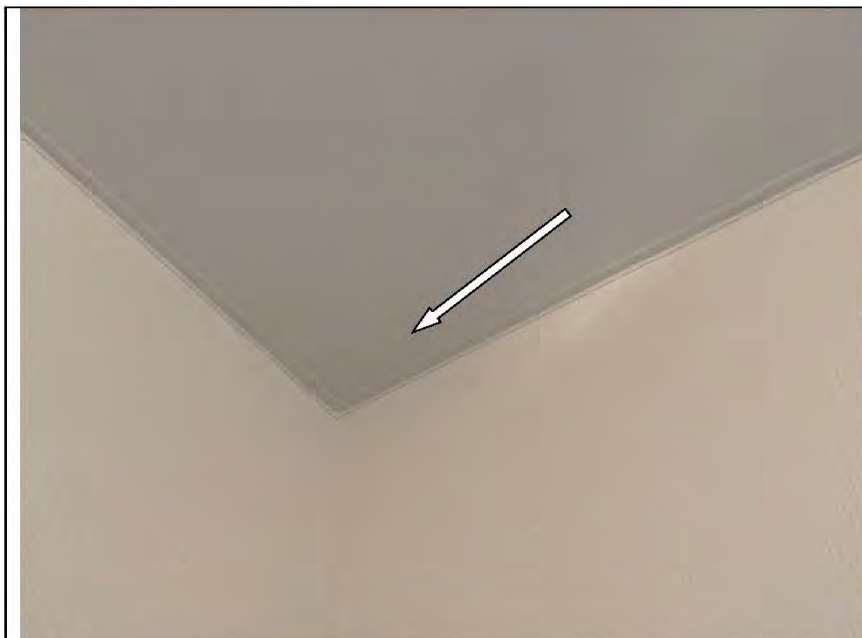
Фото №70. Загрязнения на полотне натяжного потолка в коридоре.
