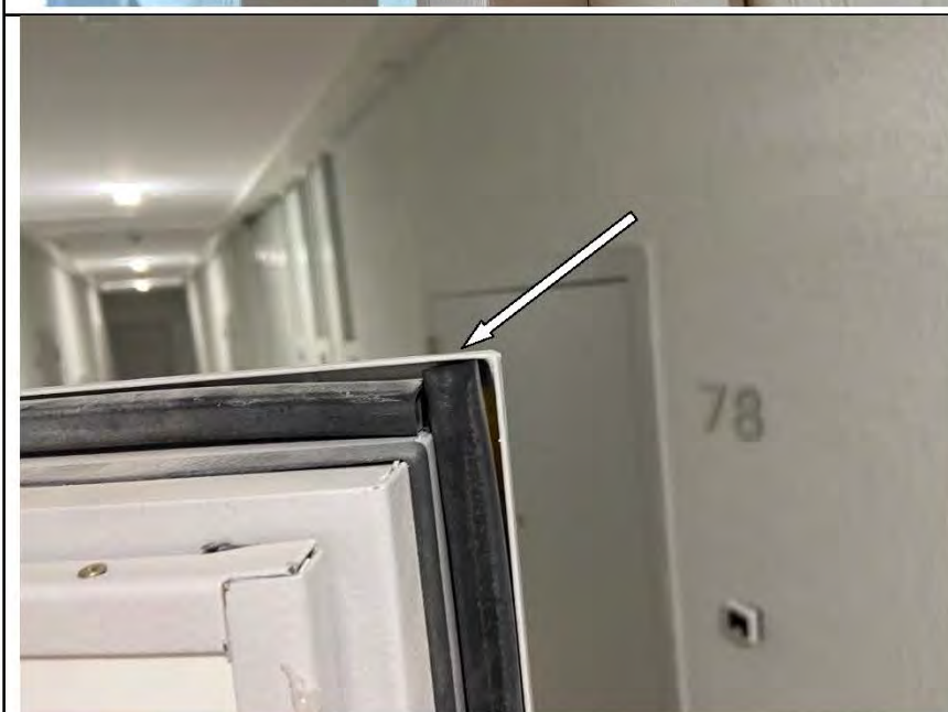
Фото №69. Дефект на противопожарной уплотняющей ленте на входном дверном блоке в коридоре.
