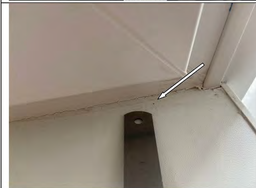
Фото №36. Царапина на лицевой стороне подоконной доски в кухне.
