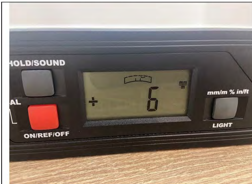
Фото №19. Отклонение напольного покрытия из ламината в гардеробной.
