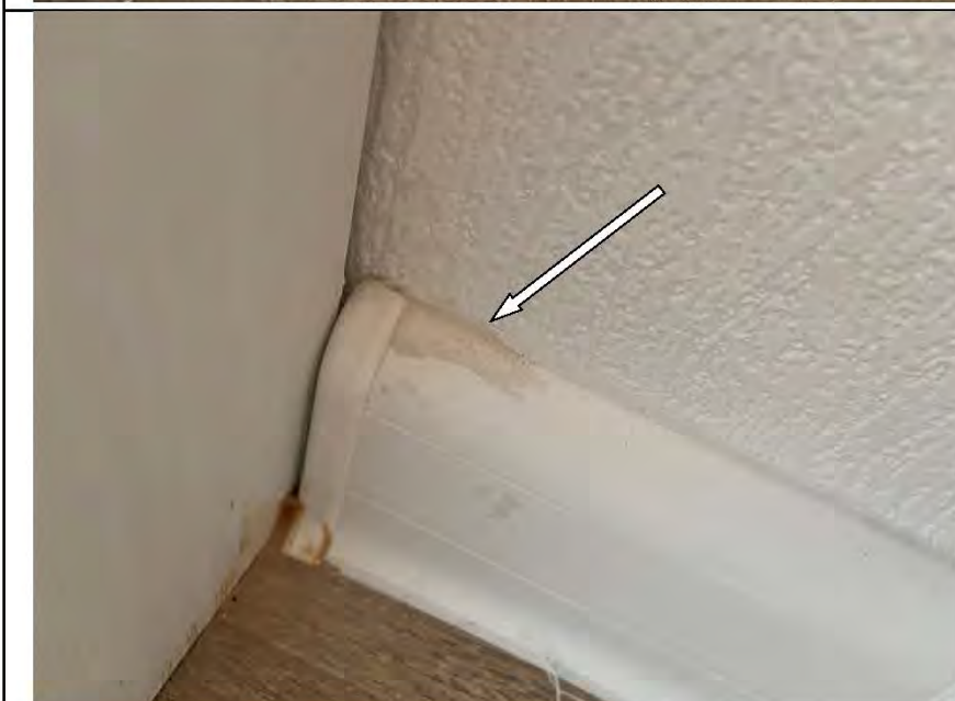
Фото №27. Загрязнения на напольном плинтусе ПВХ в кухне.
