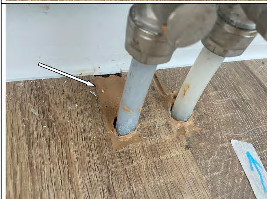
Фото №50. Дефект вставки труб отопления в напольное покрытие из ламината в спальне.
