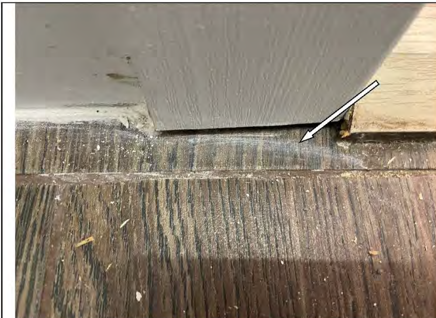
Фото №22. Загрязнения на напольном покрытии из керамической плитки в ванной комнате.
