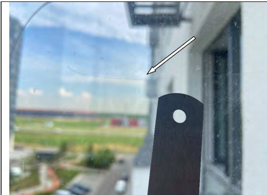
Фото №46. Царапина на стеклопакете алюминиевого оконного блока на лоджии.
