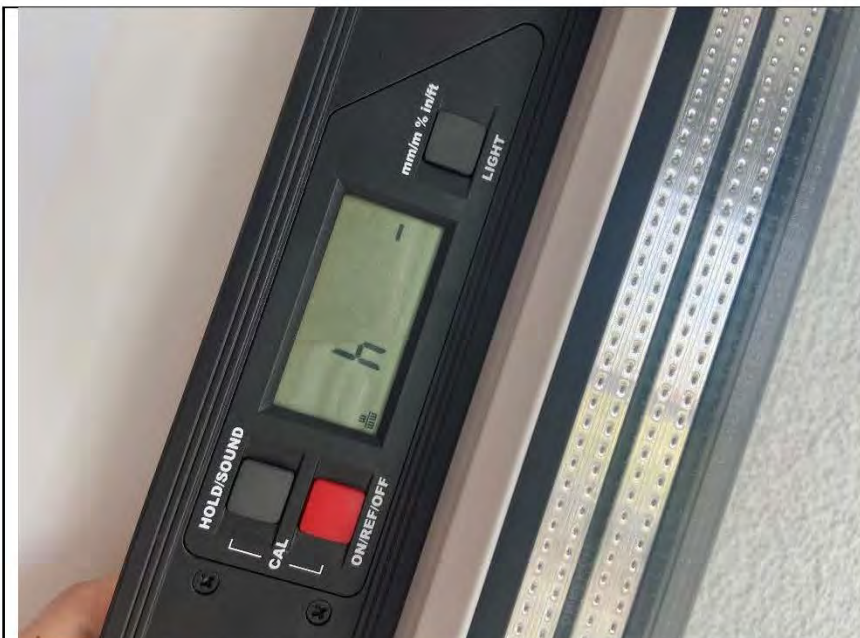
Фото №52. Отклонения по вертикали оконного блока ПВХ в кухне.
