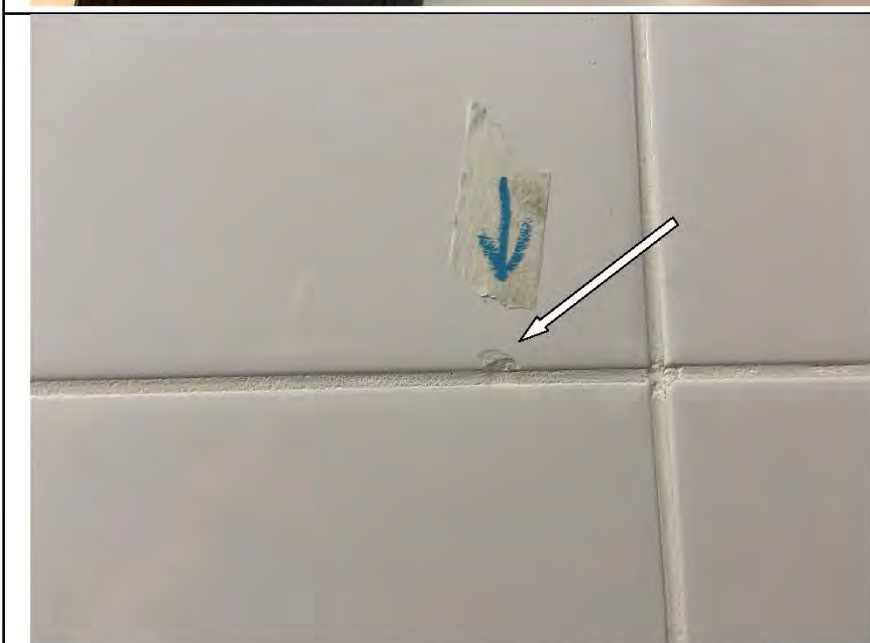
Фото №12. Скол на настенной керамической плитке в ванной комнате.
