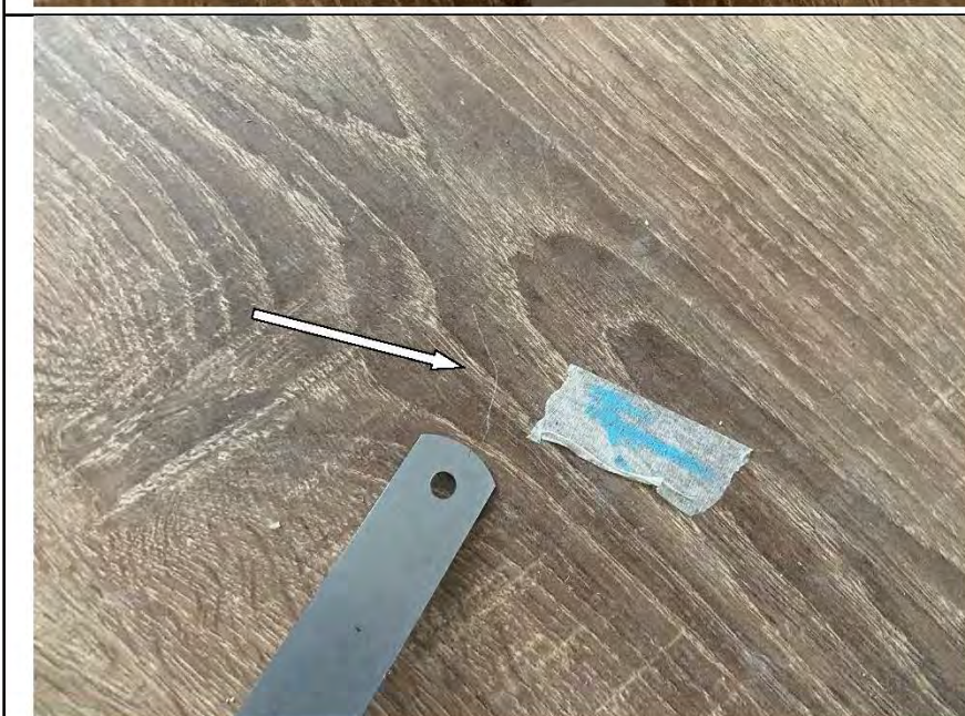
Фото №30. Дефект на напольном покрытии из ламината в коридоре.
