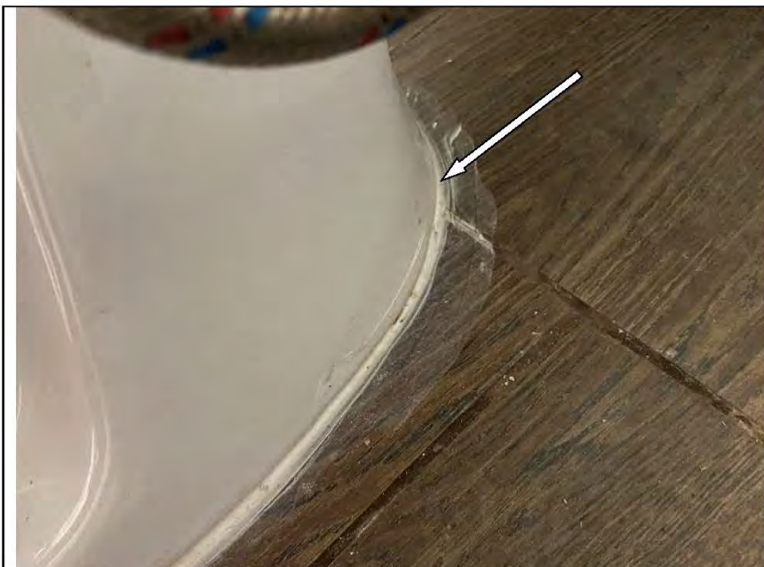
Фото №82. Загрязнения на унитазе в ванной комнате.
