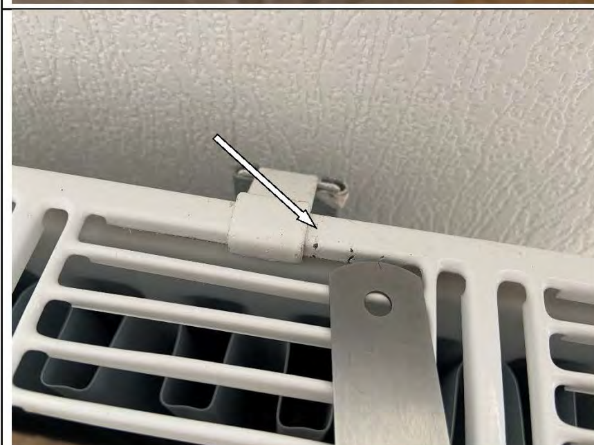
Фото №77. Загрязнения на металлическом кожухе отопительного прибора в кухне.
