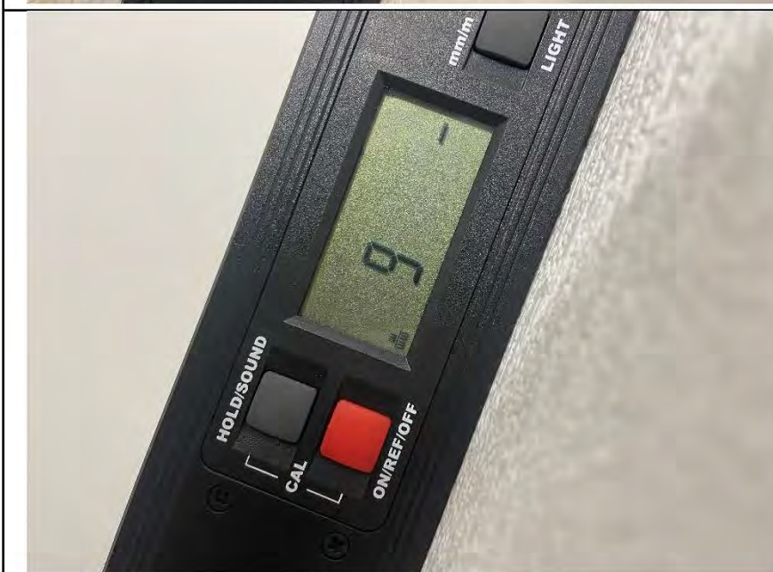
Фото №9. Отклонение поверхности стен от вертикали в гардеробной.
