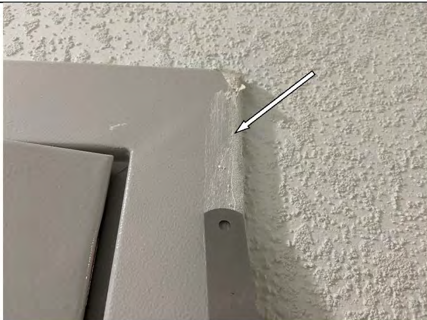
Фото №60. Дефект на наличниках входного дверного блока в коридоре.
