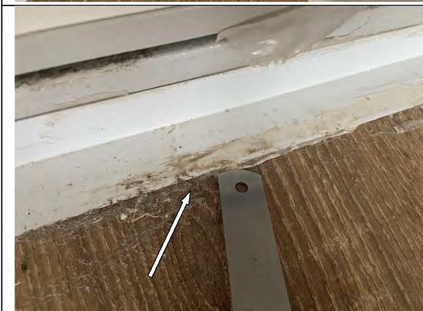
Фото №29. Дефект на напольном покрытии из ламината в коридоре.
