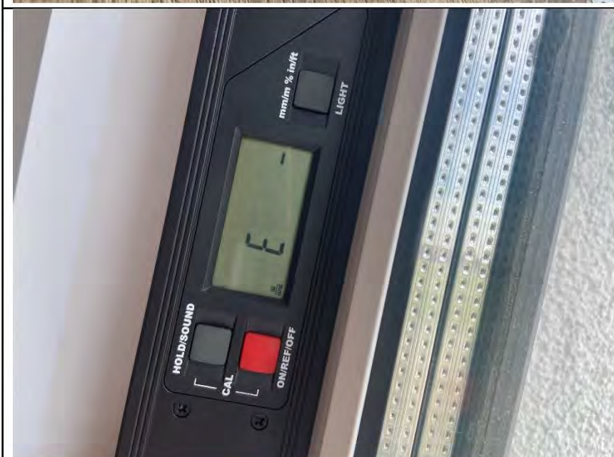
Фото №51. Отклонения по вертикали оконного блока ПВХ в кухне.
