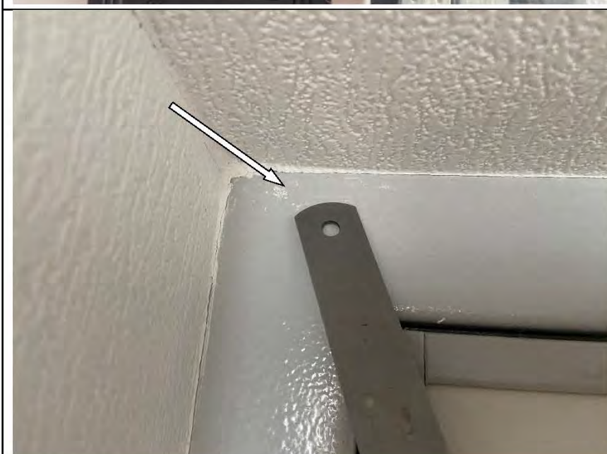
Фото №54. Загрязнения на коробке входного дверного блока в коридоре.
