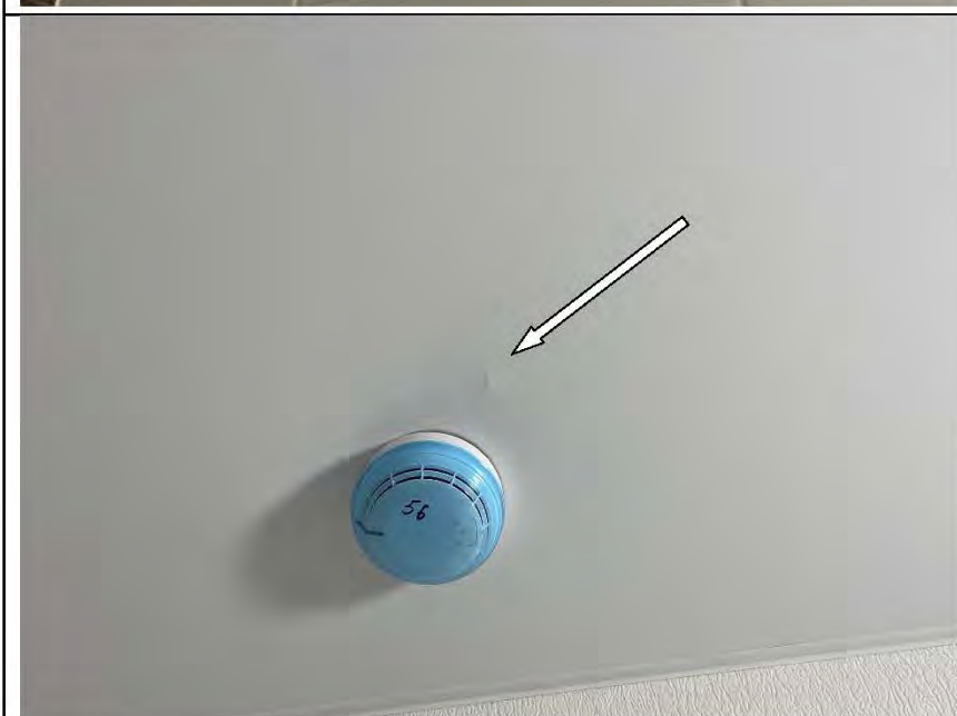
Фото №74. Видны инженерные сети на полотне натяжного потолка в гардеробной.
