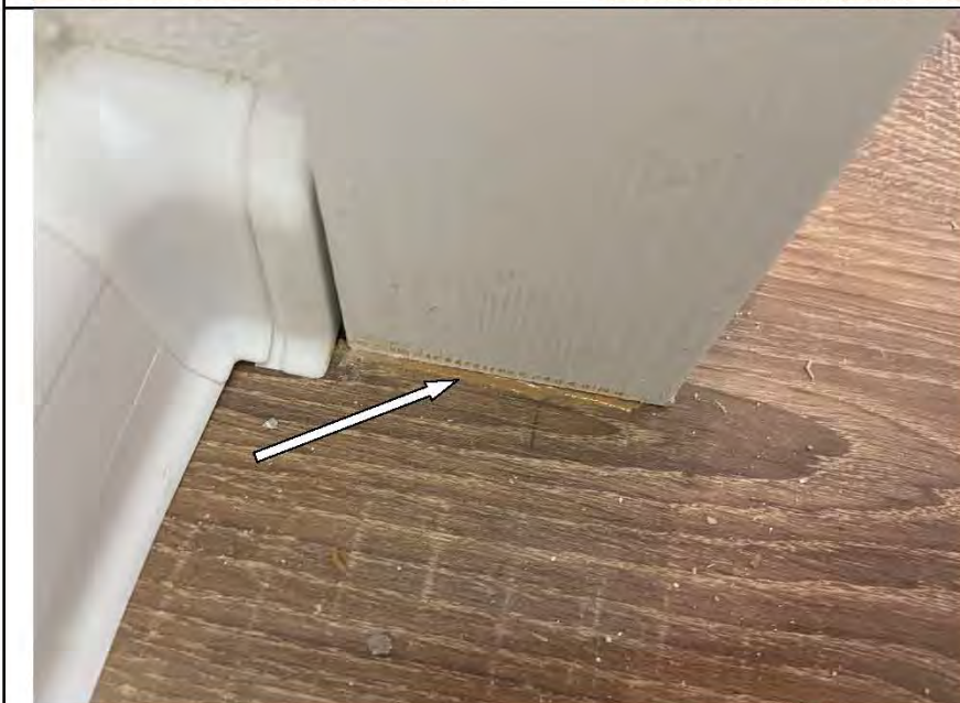
Фото №32. Дефект на напольном покрытии из ламината в гардеробной.
