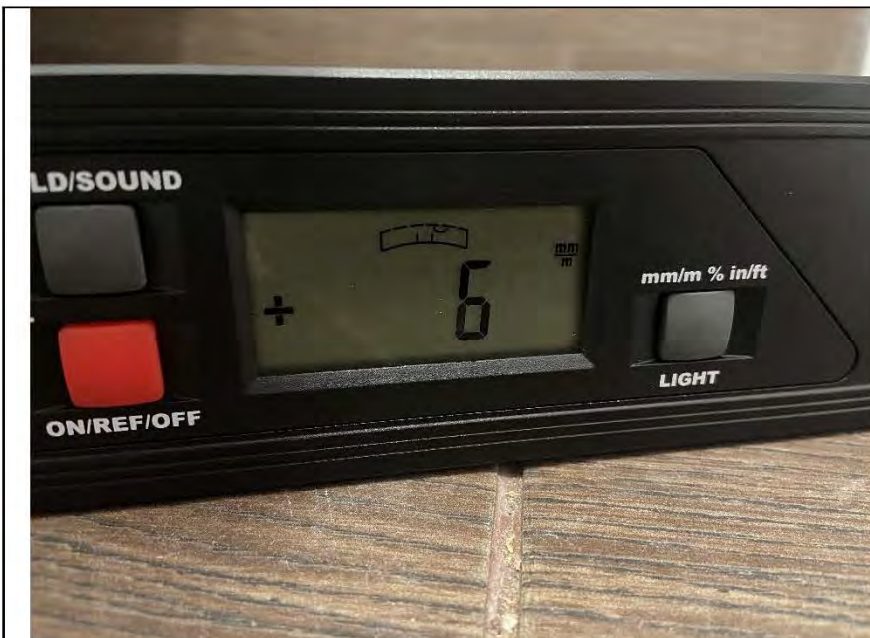
Фото №16. Отклонение напольного покрытия из керамической плитки в ванной комнате.
