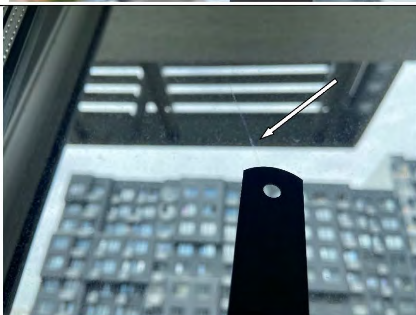
Фото №47. Царапина на стеклопакете оконного блока ПВХ в спальне.
