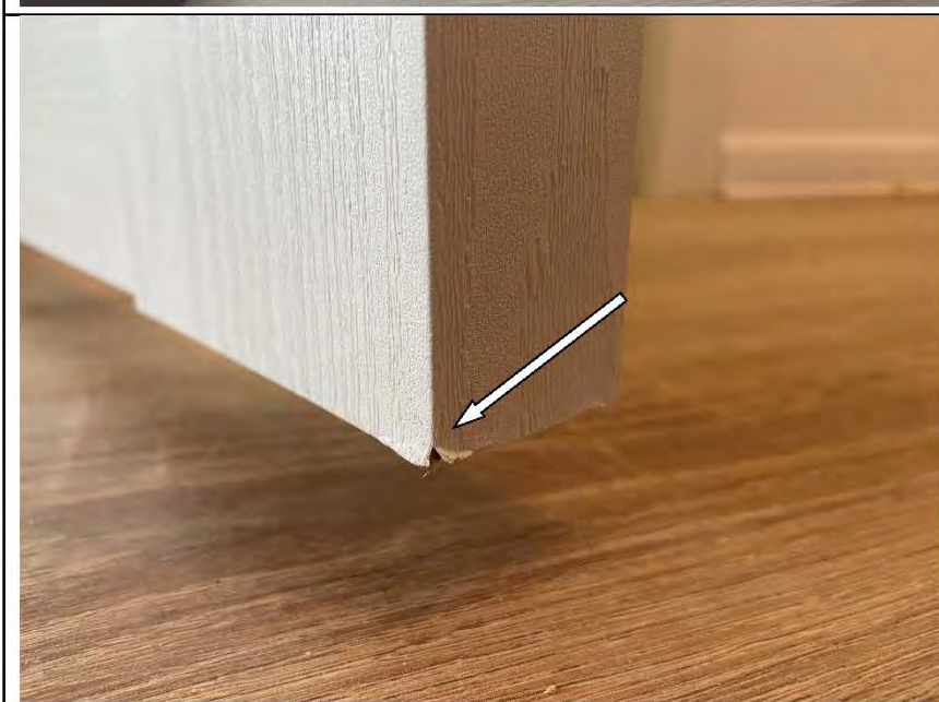
Фото №57. Дефект на полотне деревянного дверного блока в ванной комнате.
