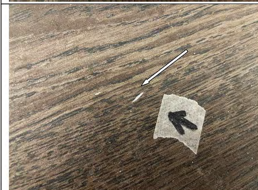
Фото №23. Механическое повреждение на напольном покрытии из керамической плитки в ванной комнате.
