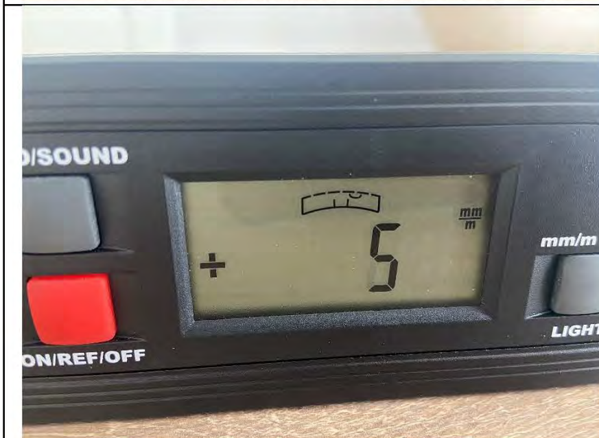
Фото №20. Отклонение напольного покрытия из ламината в спальне.
