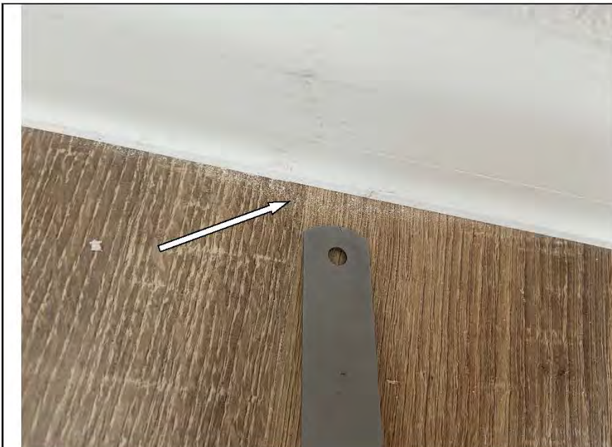
Фото №31. Дефект на напольном покрытии из ламината в кухне.
