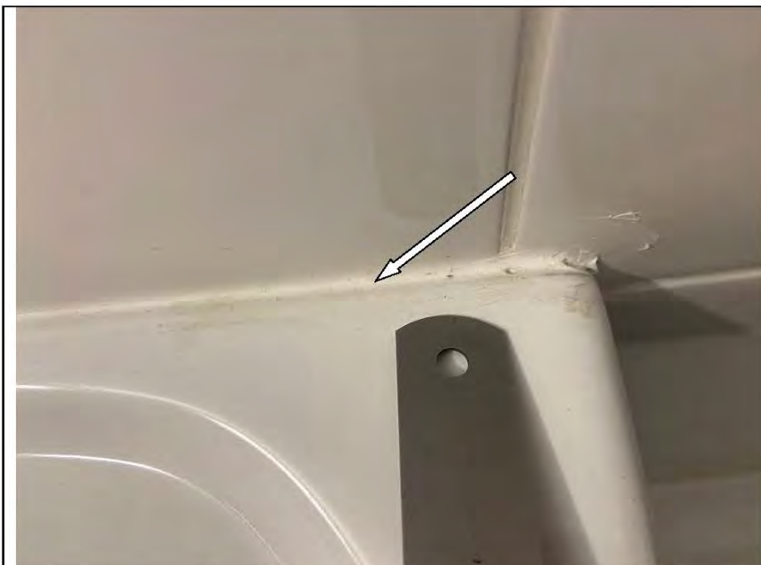
Фото №79. Загрязнения на ванне в ванной комнате.
