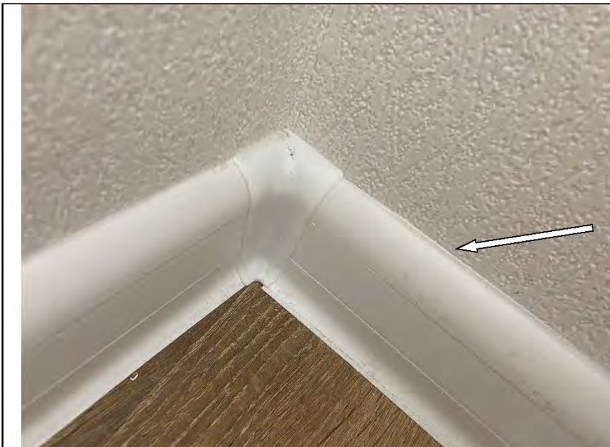
Фото №28. Загрязнения на напольном плинтусе ПВХ в спальне.
