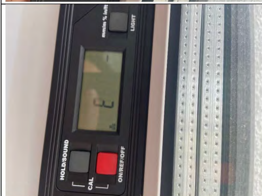
Фото №53. Отклонения по вертикали оконного блока ПВХ в спальне.
