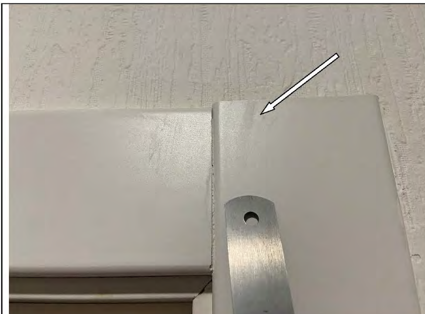
Фото №73. Дефект на наличниках деревянного дверного блока в ванной комнате.
