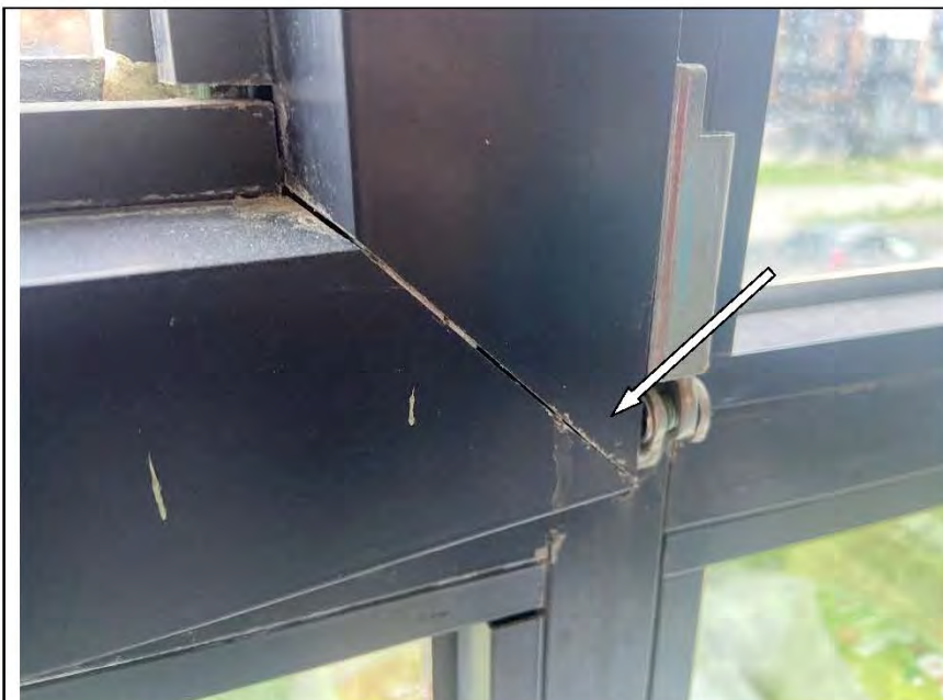
Фото №52. Дефект на алюминиевом профиле оконного блока на лоджии.
