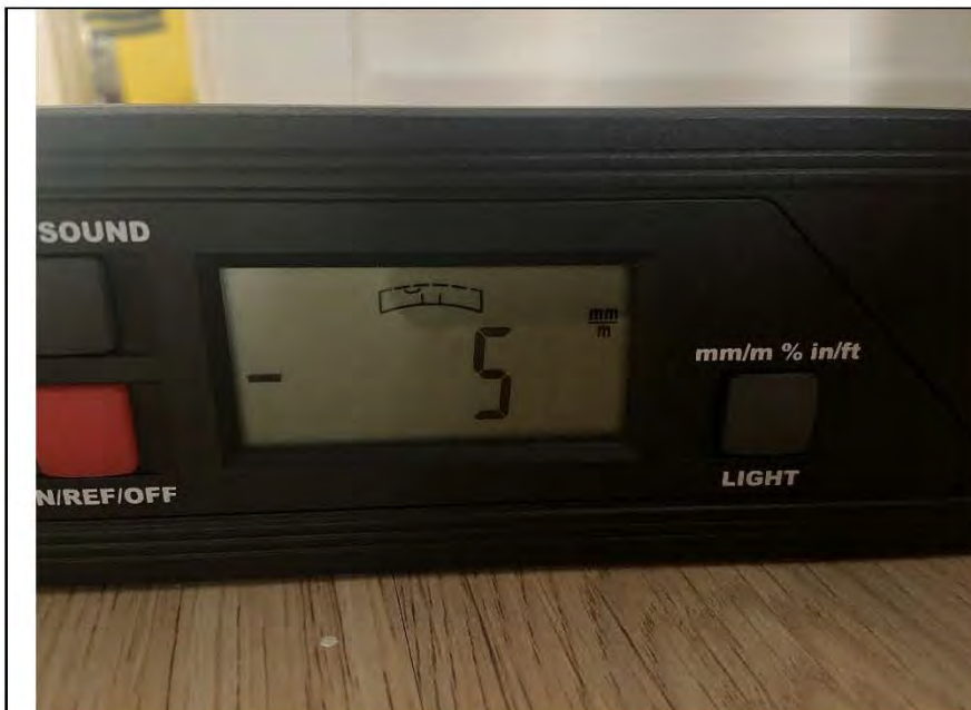
Фото №28. Отклонение поверхности напольного покрытия в спальне.
