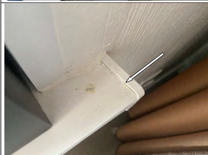
Фото №47. Царапина на лицевой стороне подоконной доски в спальне.
