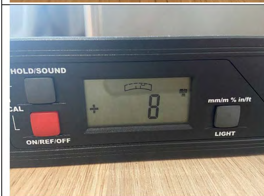
Фото №27. Отклонение поверхности напольного покрытия в кухне.
