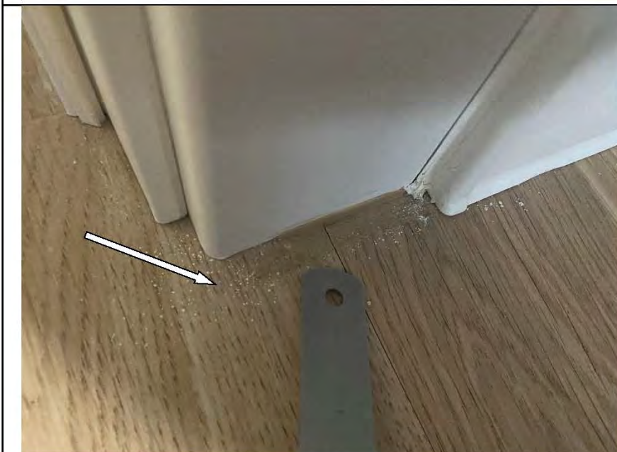
Фото №41. Дефект на напольном покрытии из ламината в спальне.
