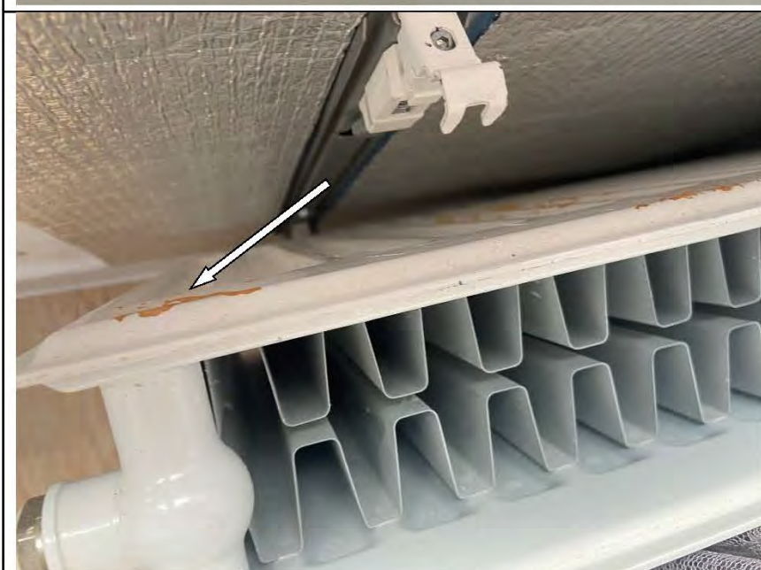
Фото №89. Загрязнения на металлическом кожухе отопительного прибора в кухне.
