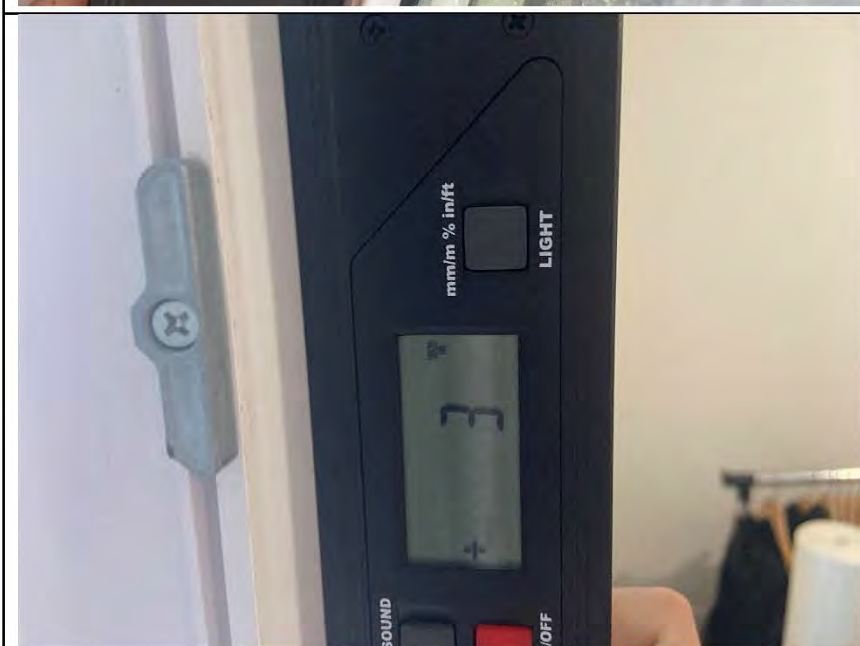
Фото №63. Отклонение по вертикали оконного блока ПВХ в детской.
