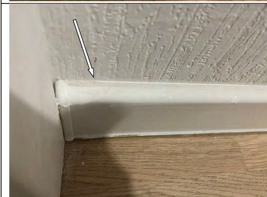
Фото №35. Загрязнения на напольном плинтусе ПВХ в кухне.
