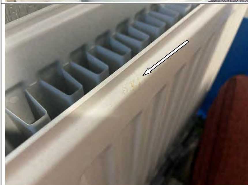
Фото №90. Загрязнения на металлическом кожухе отопительного прибора в детской.
