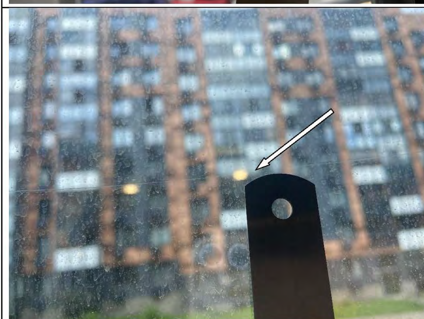
Фото №56. Царапина на стеклопакете оконного блока ПВХ на лоджии.
