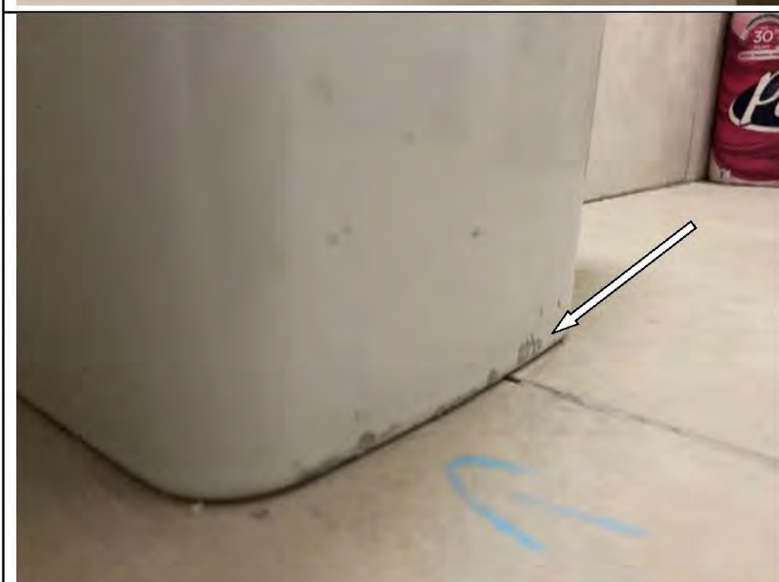
Фото №93. Загрязнения на раковине в санузле.
