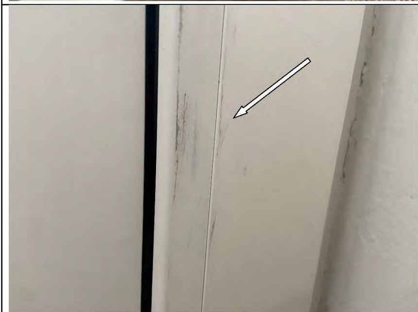
Фото №48. Загрязнения на профиле оконного блока ПВХ в кухне.
