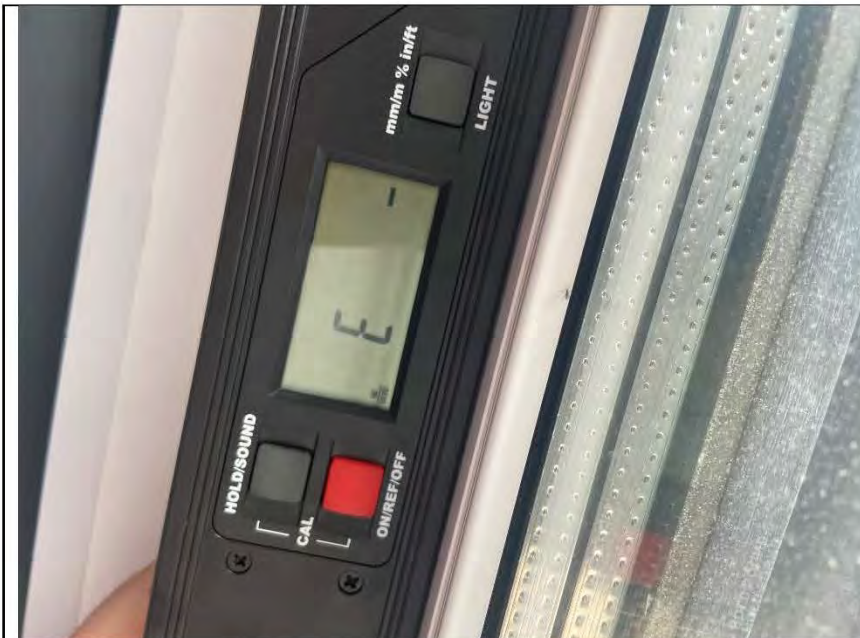
Фото №61. Отклонение по вертикали оконного блока ПВХ в кухне.
