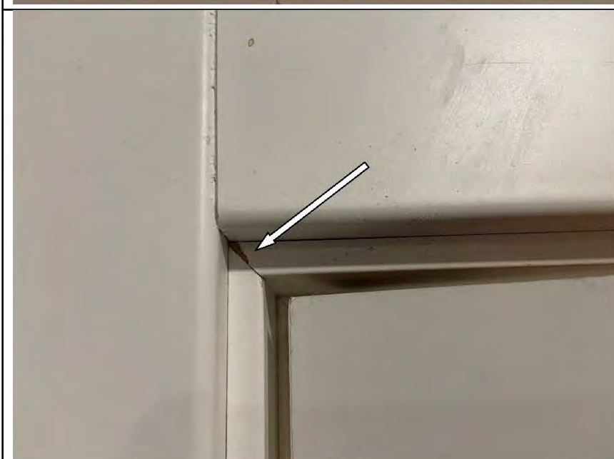
Фото №78. Дефект на коробке деревянного дверного блока в ванной комнате.
