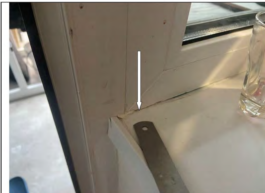
Фото №46. Царапина на лицевой стороне подоконной доски в детской.
