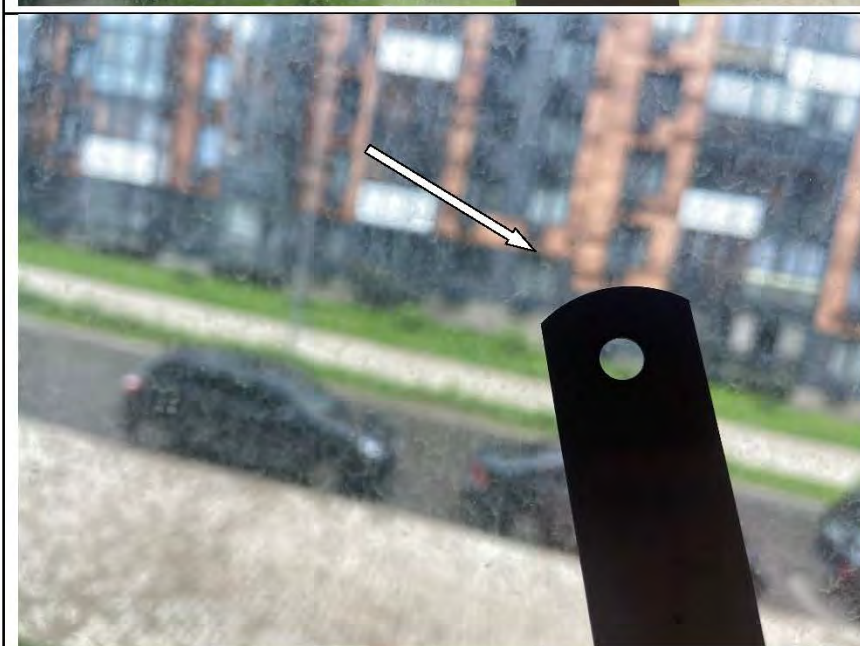
Фото №57. Царапина на стеклопакете оконного блока ПВХ в спальне.
