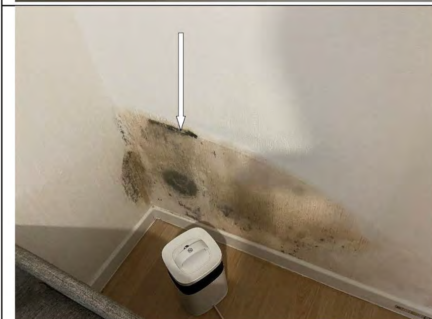
Фото №17. Следы залития на стене в детской.
