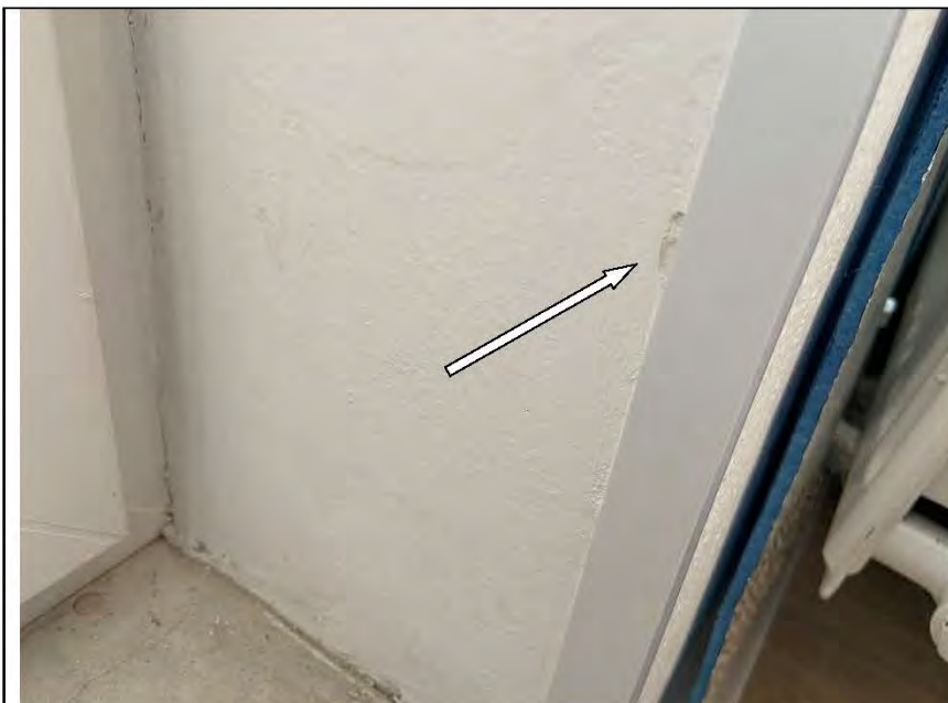
Фото №58. Неровности, выбоины, раковины на окрашенных откосах оконного блока ПВХ в кухне.
