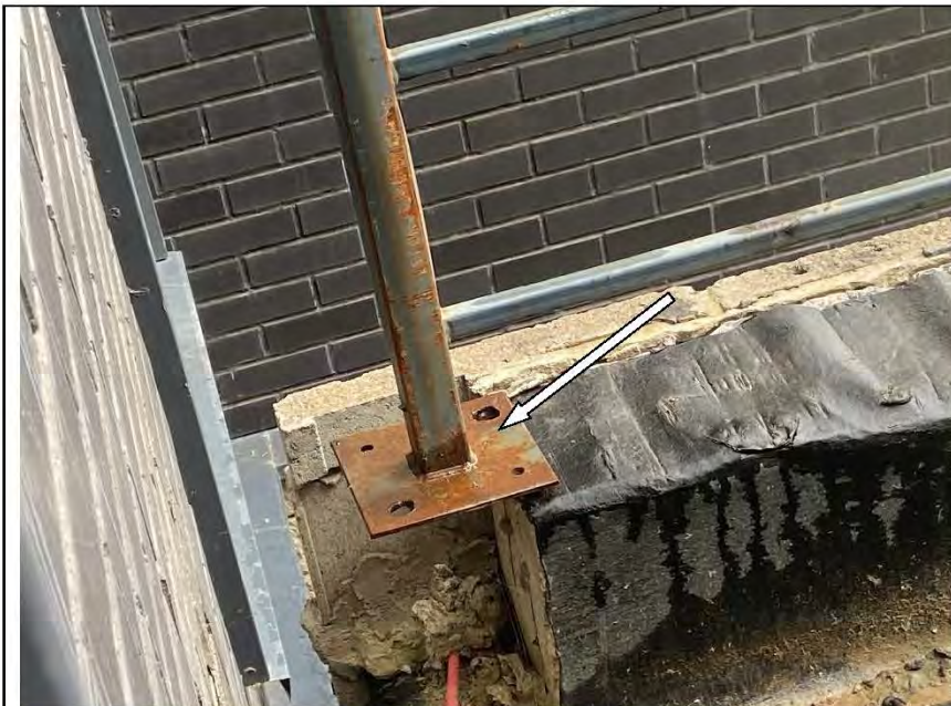
Фото №94. Коррозия на металлическом ограждении на террасе.
