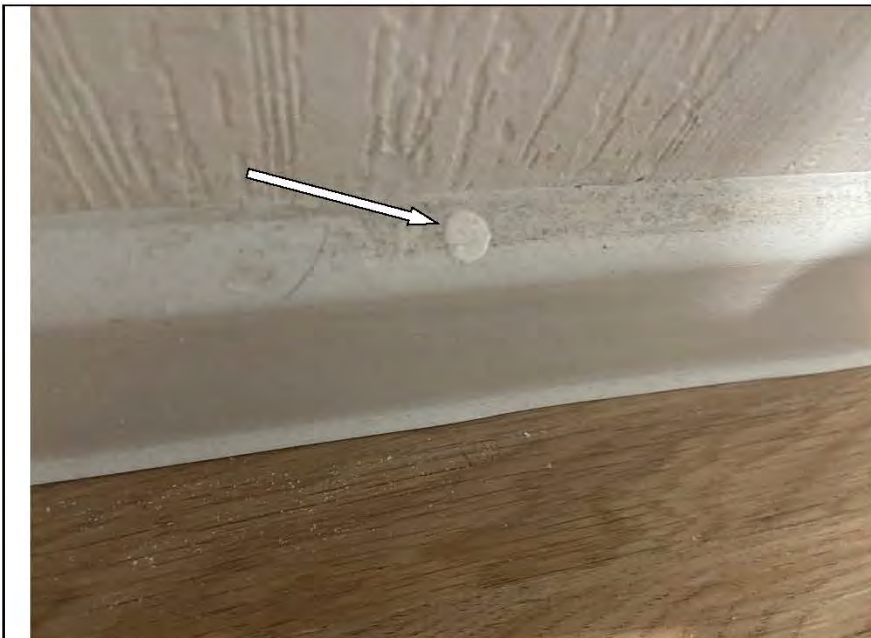
Фото №34. Загрязнения на напольном плинтусе ПВХ в коридоре.
