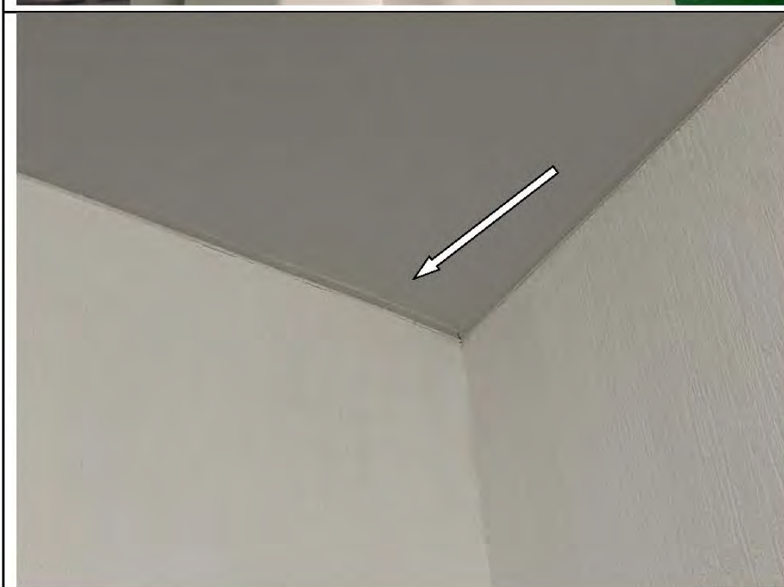
Фото №83. Загрязнения на полотне натяжного потолка в коридоре.
