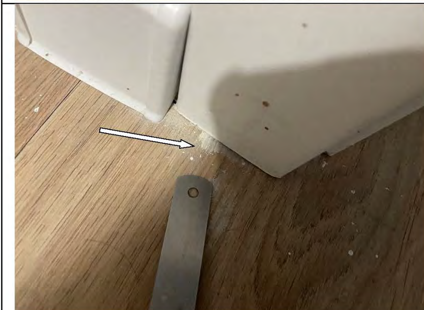
Фото №38. Дефект на напольном покрытии из ламината в коридоре.
