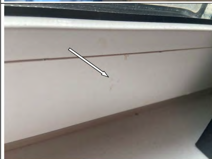
Фото №51. Загрязнения на профиле оконного блока ПВХ в спальне.
