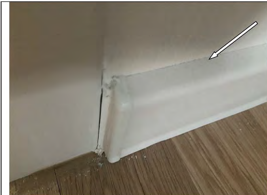
Фото №37. Загрязнения на напольном плинтусе ПВХ в спальне.
