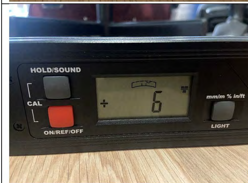
Фото №29. Отклонение поверхности напольного покрытия в детской.
