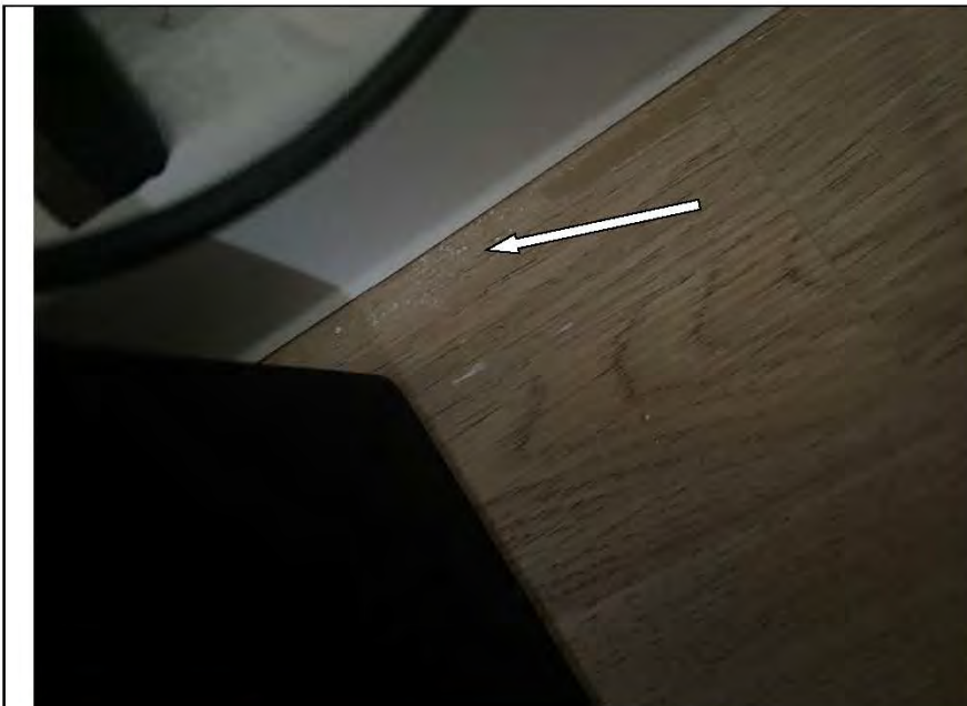
Фото №40. Дефект на напольном покрытии из ламината в кухне.
