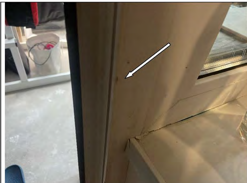
Фото №49. Загрязнения на профиле оконного блока ПВХ в детской.
