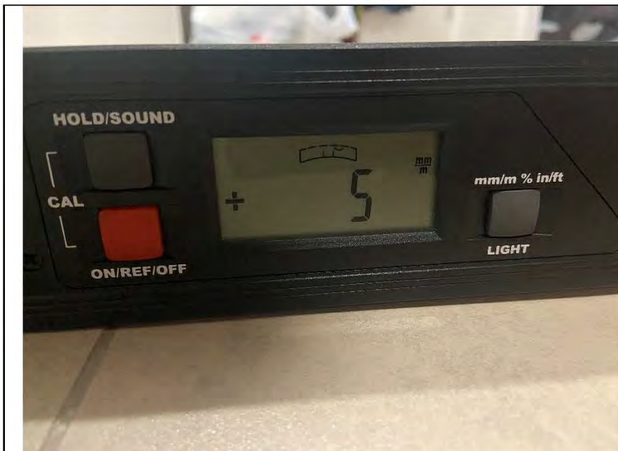
Фото №25. Отклонение поверхности напольного покрытия в ванной комнате.
