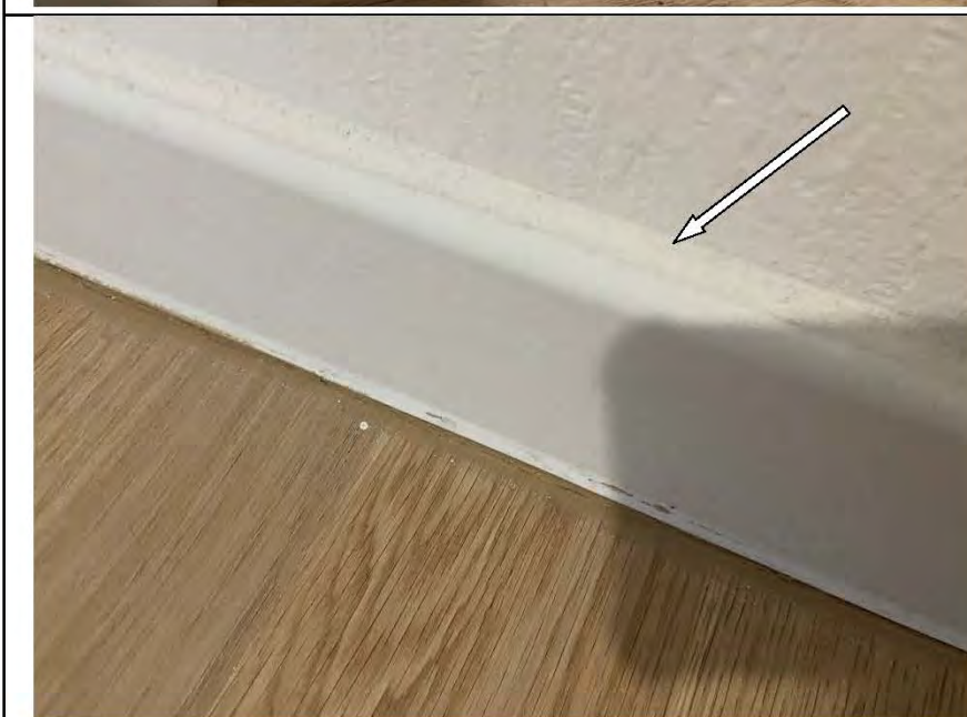
Фото №36. Загрязнения на напольном плинтусе ПВХ в детской.
