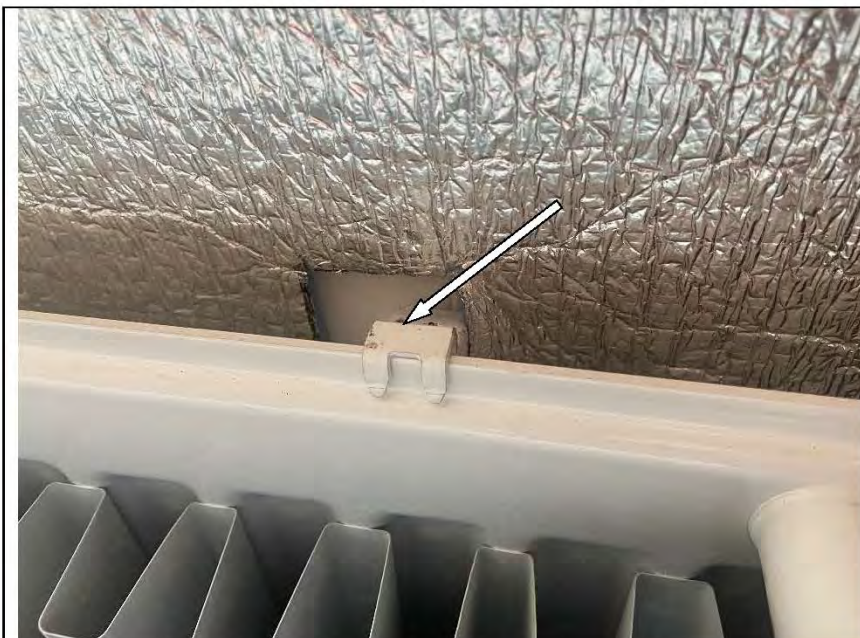
Фото №91. Загрязнения на металлическом кожухе отопительного прибора в спальне.
