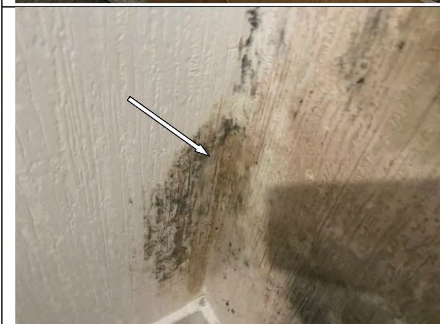
Фото №18. Следы залития на стене в детской.
