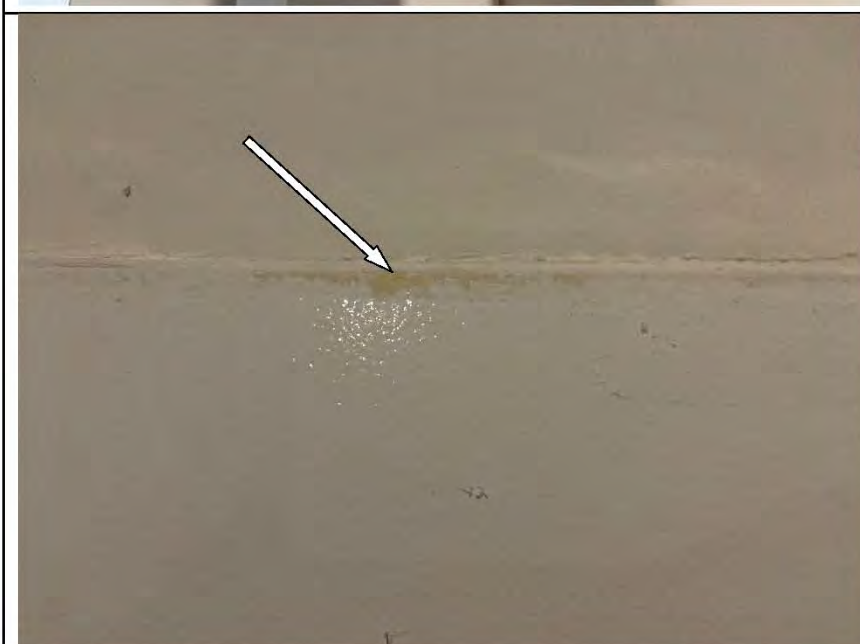
Фото №77. Дефект на наличниках входного дверного блока в коридоре.
