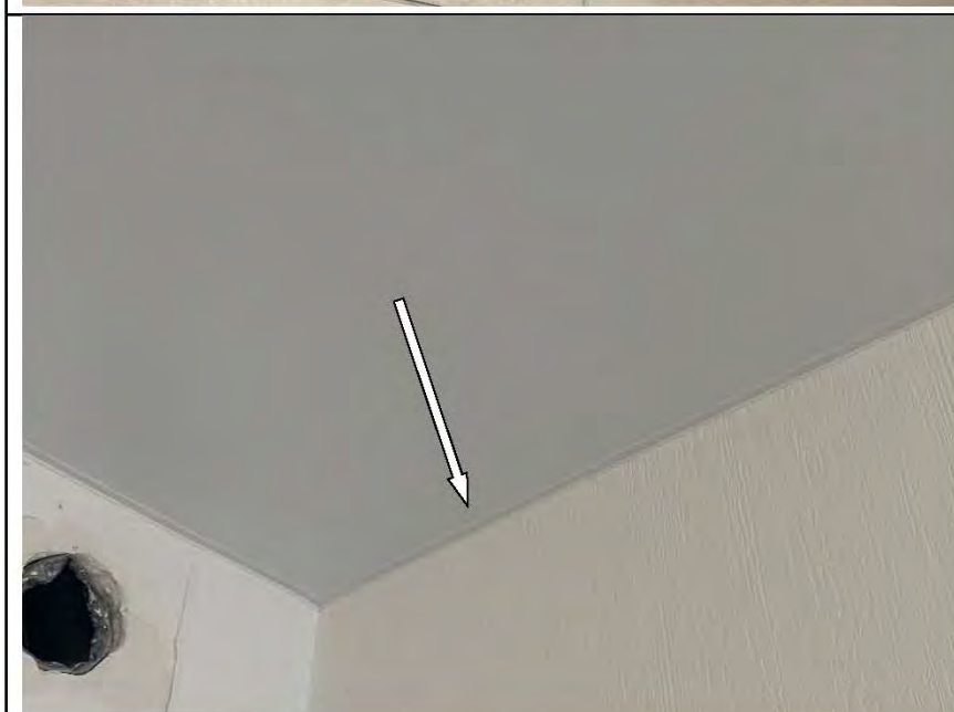
Фото №86. Загрязнения на полотне натяжного потолка в кухне.
