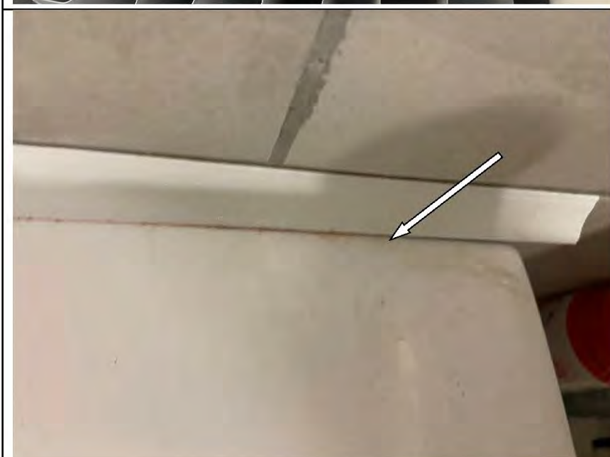
Фото №92. Загрязнения на ванне в ванной комнате.
