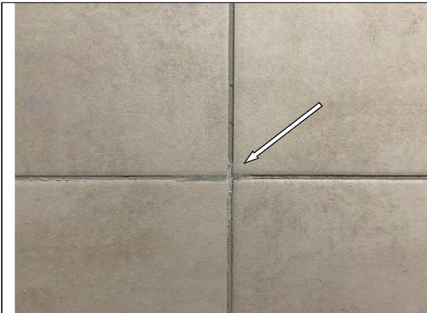
Фото №22. Неровные швы настенной керамической плитки в санузле.
