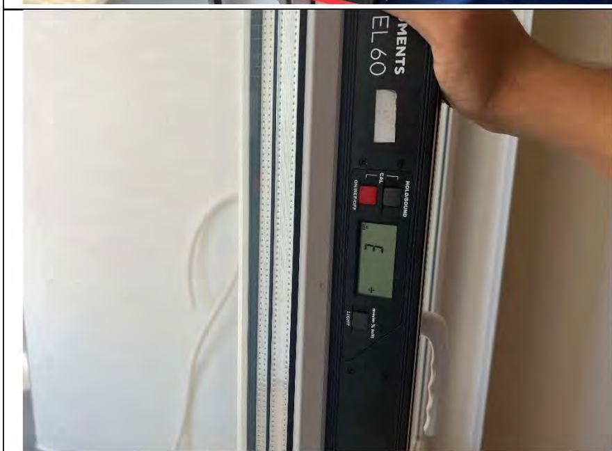
Фото №36. Отклонение коробки балконного дверного блока ПВХ в кухне по уровню вертикальности составляет 3 мм.
