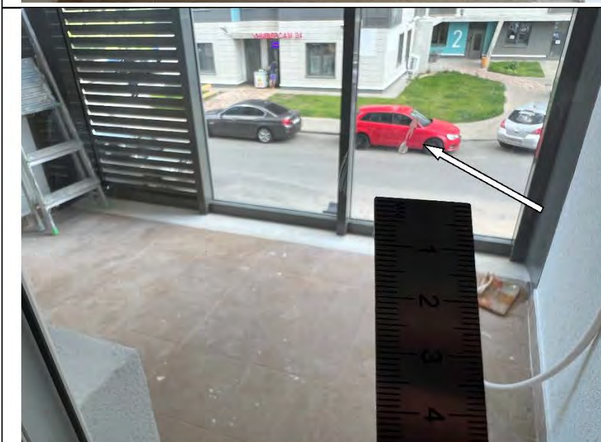
Фото №26. Окарины на стеклопакете дверного блока ПВХ в кухне.
