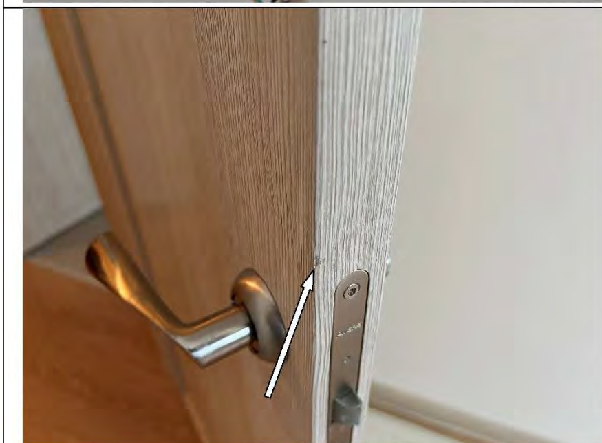
Фото №41. Скол ламинации на полотне дверного блока в спальне.
