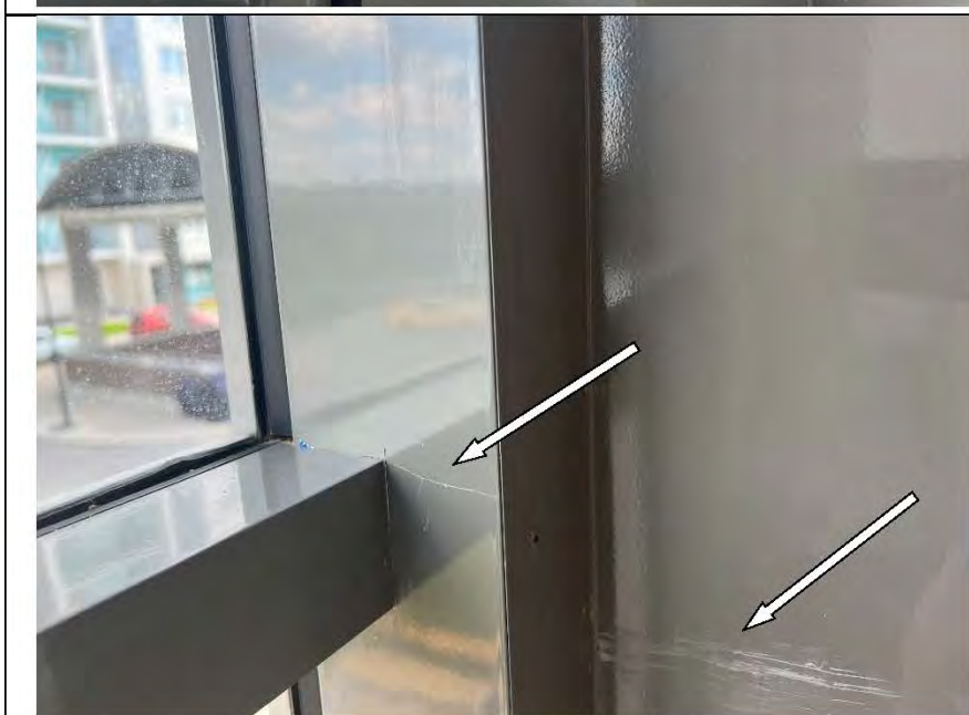
Фото №33. Царапины на металлическом профиле оконного блока на лоджии.
