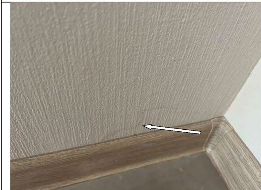
Фото №11. Вздутие обойного полотна в кухне.
