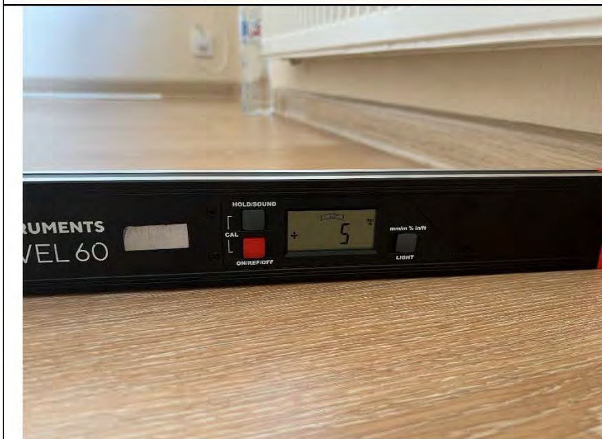
Фото №17. Измерение уровня напольного покрытия в спальне.
