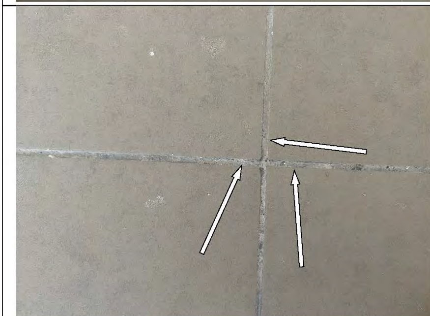
Фото №20. Разная толщина швов напольной керамической плитки в кухне.
