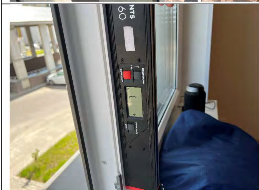
Фото №35. Отклонение оконного блока в спальне по уровню вертикальности составляет 7 мм.
