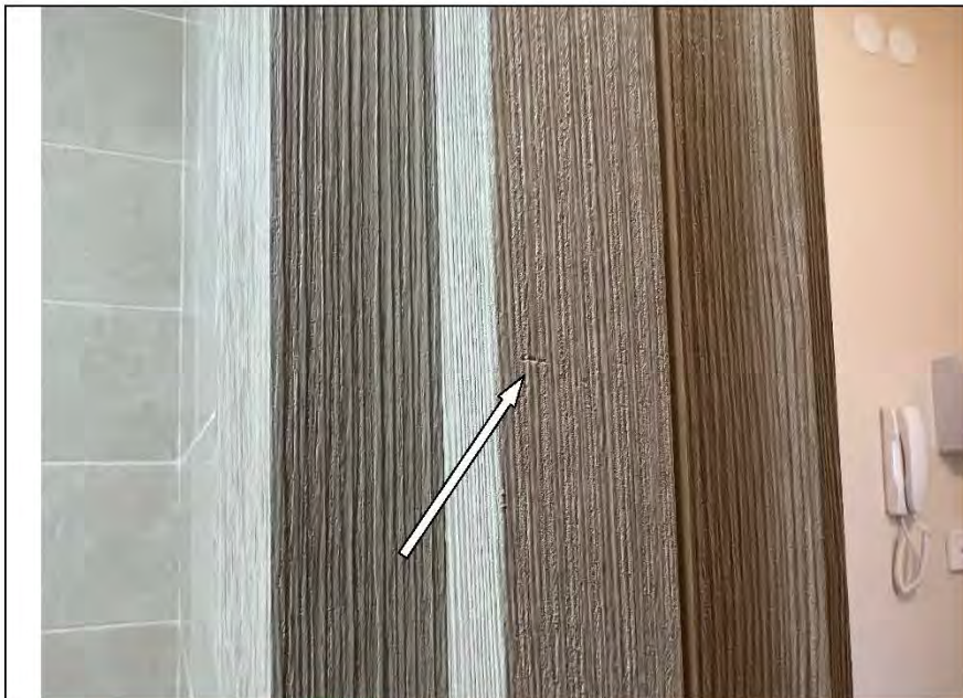
Фото №46. Скол на коробке дверного блока в ванной комнате.
