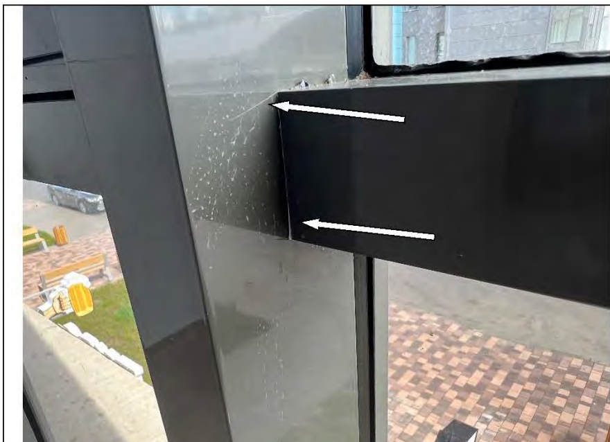
Фото №34. Царапины на металлическом профиле оконного блока на лоджии.
