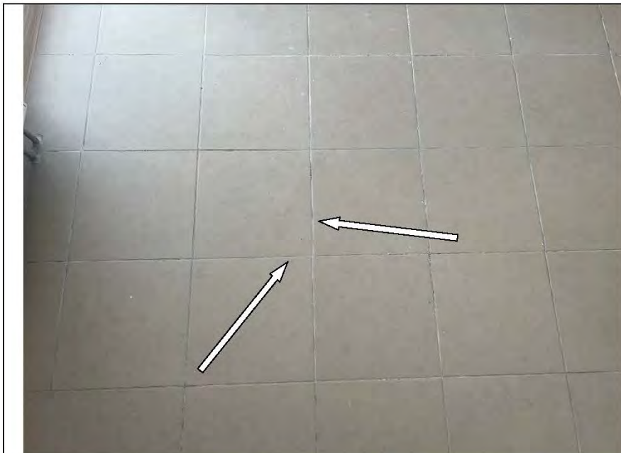
Фото №19. Швы напольной керамической плитки в кухне не перпендикулярны (нарушение параллельности смежных плиток).
