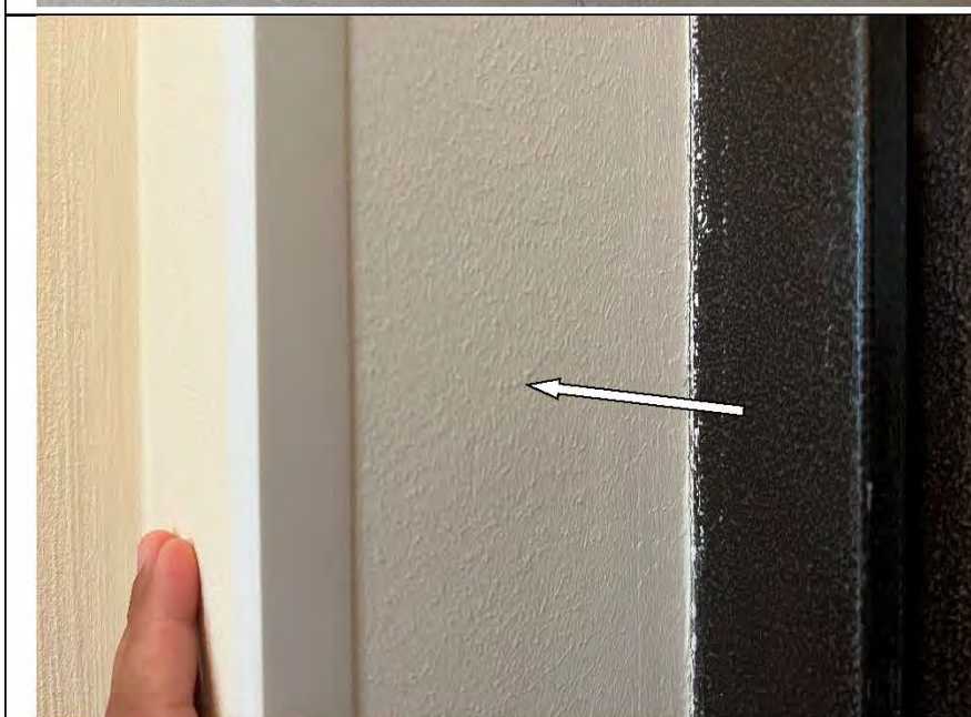
Фото №21. Подтеки краски на откосах входного дверного блока.
