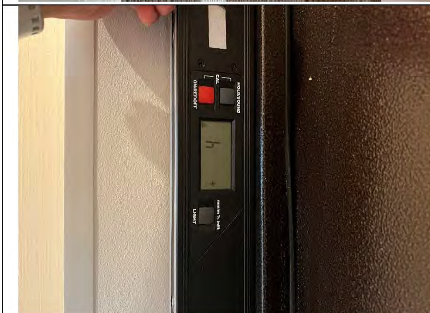
Фото №47. Отклонение коробки входного дверного блока составляет 4 мм.
