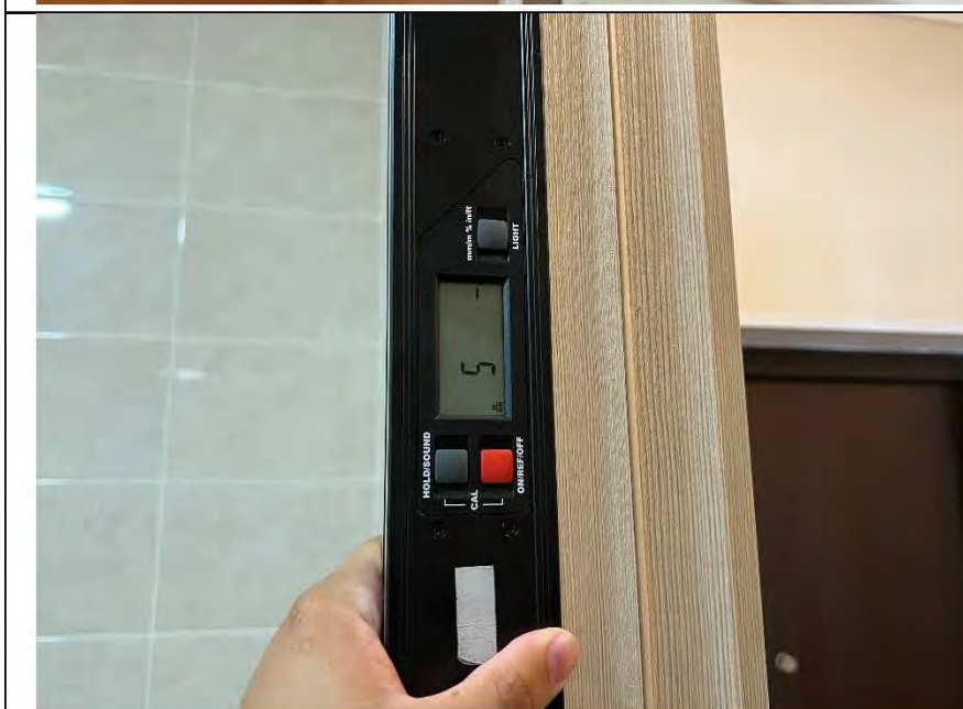
Фото №42. Отклонение коробки от плоскостности и прямолинейности дверного блока в ванной комнате составляет 5 мм.
