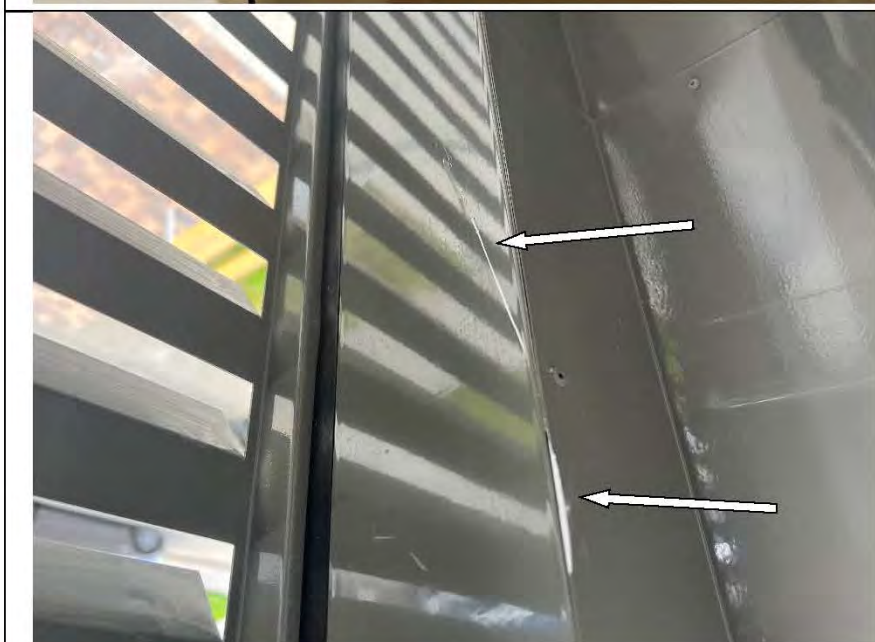
Фото №32. Царапины на металлическом профиле оконного блока на лоджии.
