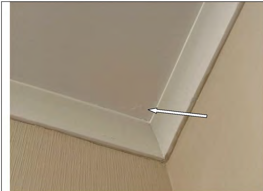
Фото №37. Подтеки краски на поверхности потолка в коридоре.
