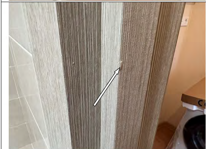
Фото №45. Скол на коробке дверного блока в ванной комнате.
