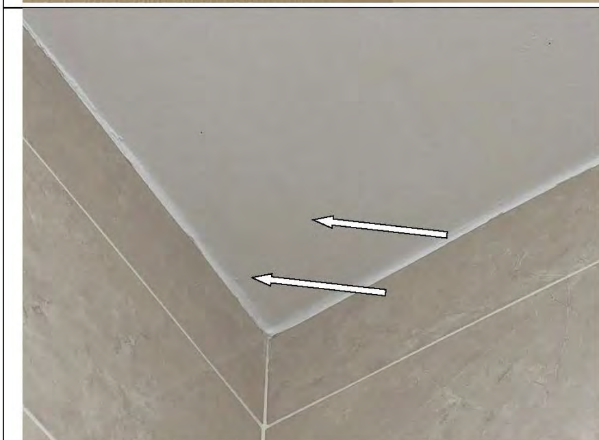
Фото №38. Подтеки краски на поверхности потолка в ванной комнате.
