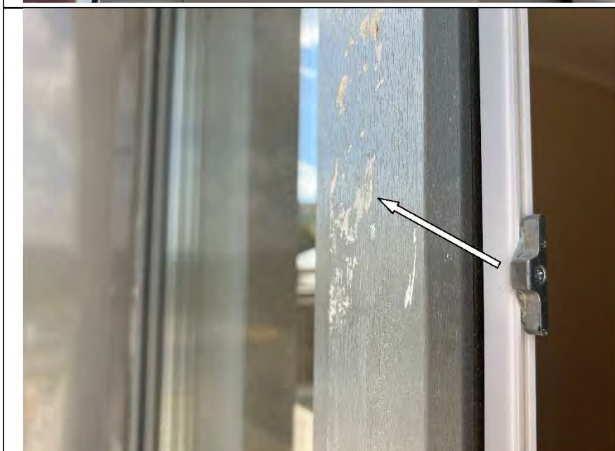
Фото №29. Загрязнение цементным раствором лицевой поверхности профиля ПВХ оконного блока в спальне.
