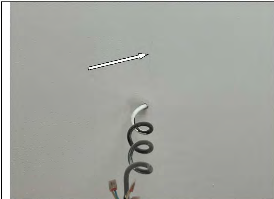
Фото №40. Трещина на окрашенном потолке в спальне.
