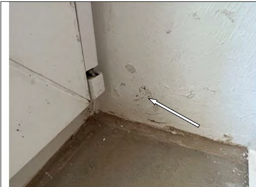
Фото №25. Отслоение штукатурного слоя на окрашенном откосе дверного блока ПВХ в кухне.
