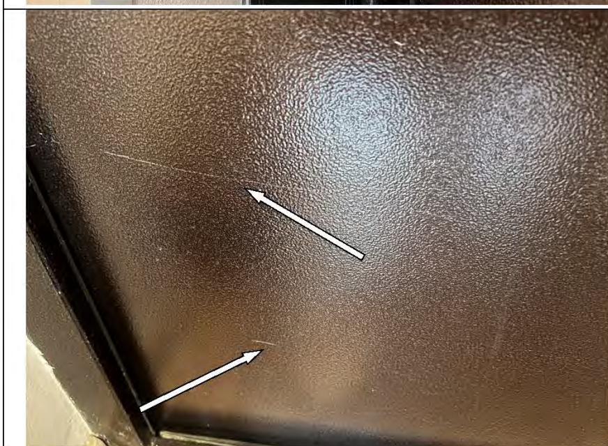
Фото №48. Царапины на полотне входного дверного блока.
