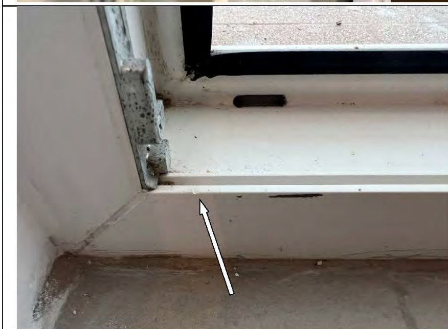
Фото №30. Скол на коробке дверного блока ПВХ в кухне.
