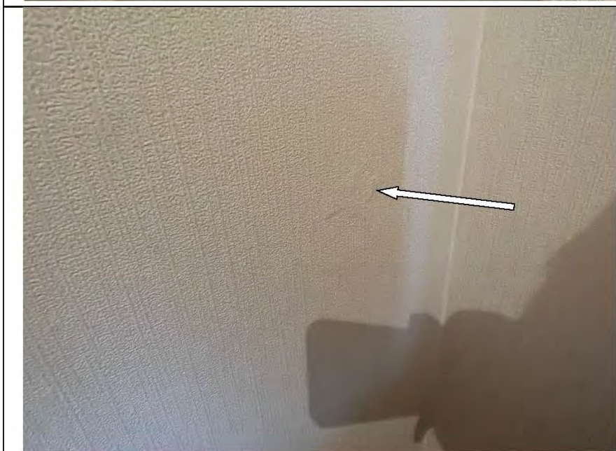
Фото №12. Вздутие обойного полотна в коридоре.
