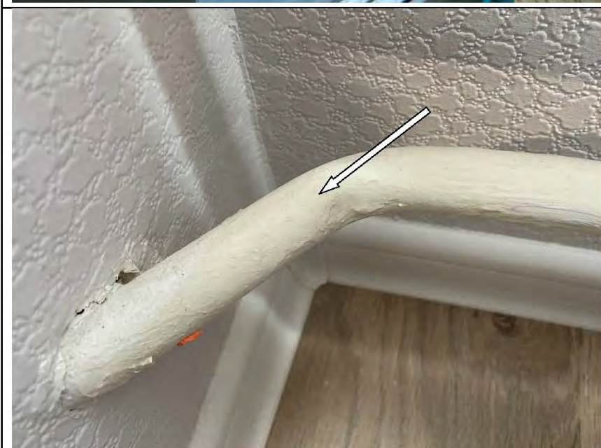
Фото №56. Неровности, подтеки на окрашенных трубах отопления в кухне.
