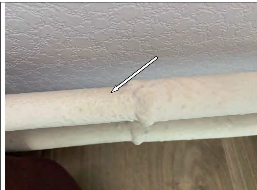
Фото №58. Неровности, подтеки на окрашенных трубах отопления в детской.
