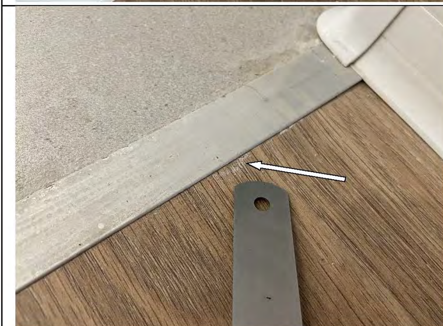
Фото №35. Дефект на напольном покрытии из ламината в кухне.
