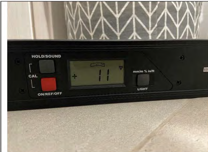
Фото №22. Отклонение напольного покрытия из керамической плитки в ванной комнате.
