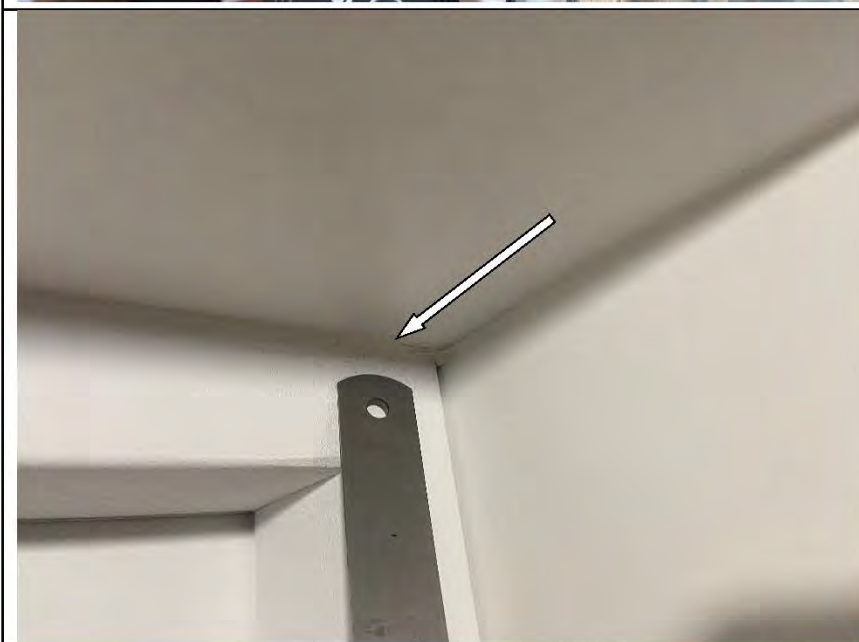
Фото №63. Загрязнения на коробке входного дверного блока в коридоре.
