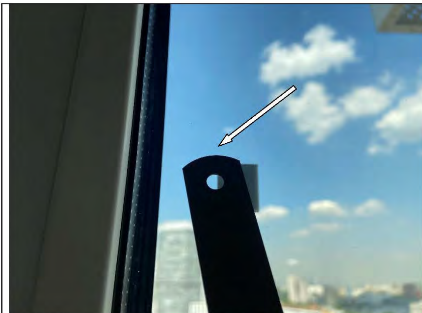
Фото №52. Царапина на стеклопакете оконного блока ПВХ в кухне.
