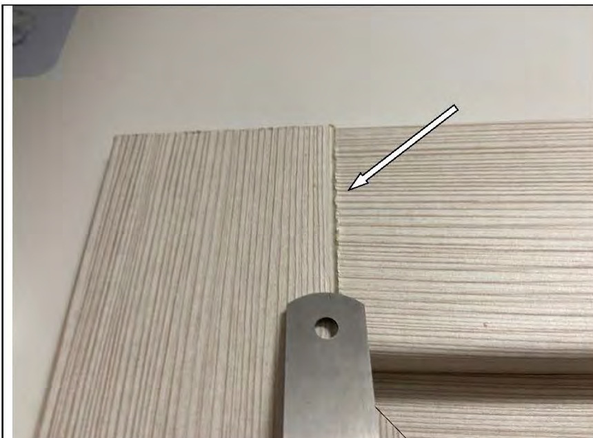
Фото №67. Сколы на наличнике деревянного дверного блока в ванной комнате.
