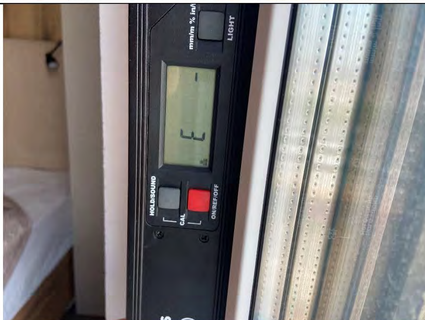
Фото №62. Отклонение по вертикали оконного блока ПВХ в спальне.
