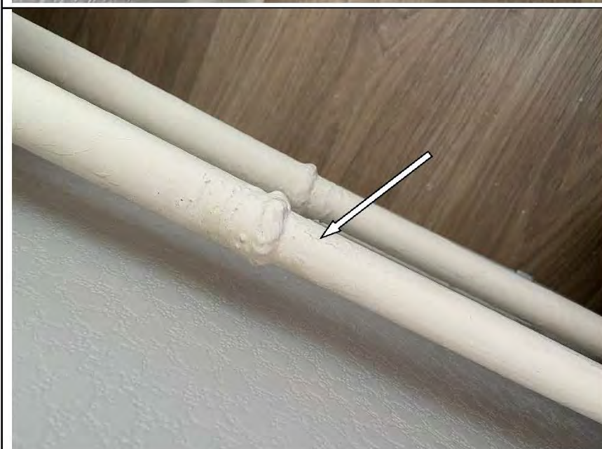
Фото №57. Неровности, подтеки на окрашенных трубах отопления в спальне.
