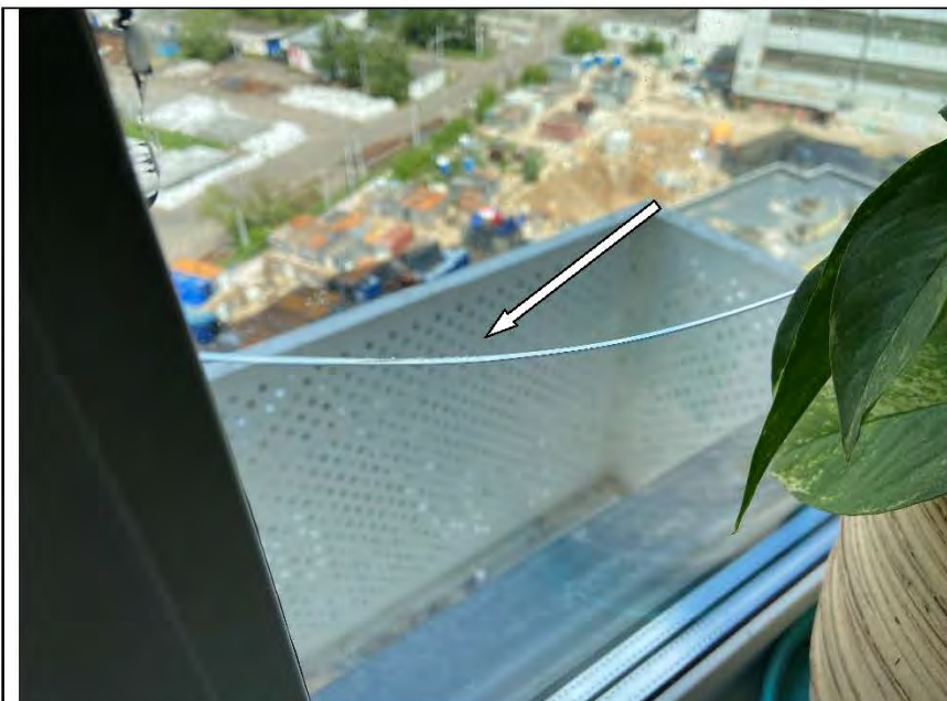
Фото №55. Трещина на стеклопакете оконного блока ПВХ в кухне.
