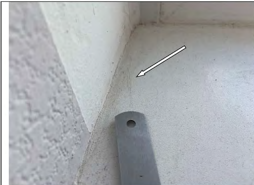
Фото №40. Дефект на лицевой стороне подоконной доски в кухне.
