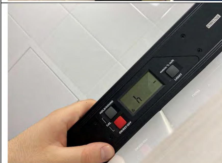
Фото №11. Отклонение поверхности стен от вертикали в санузле.
