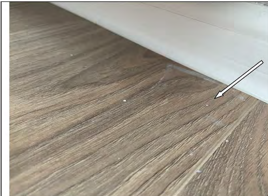
Фото №37. Дефект на напольном покрытии из ламината в детской.
