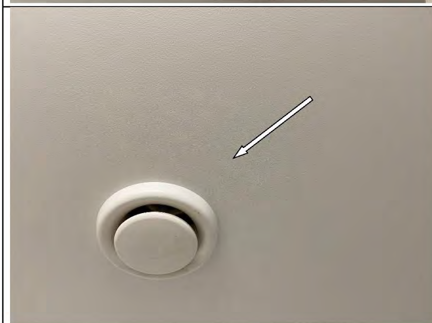
Фото №78. Загрязнения на полотне натяжного потолка в ванной комнате.
