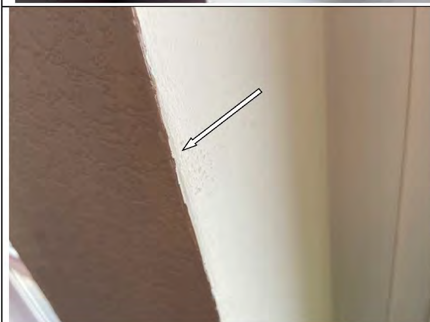
Фото №47. Неровности, выбоины, раковины на окрашенных откосах оконного блока ПВХ в детской.
