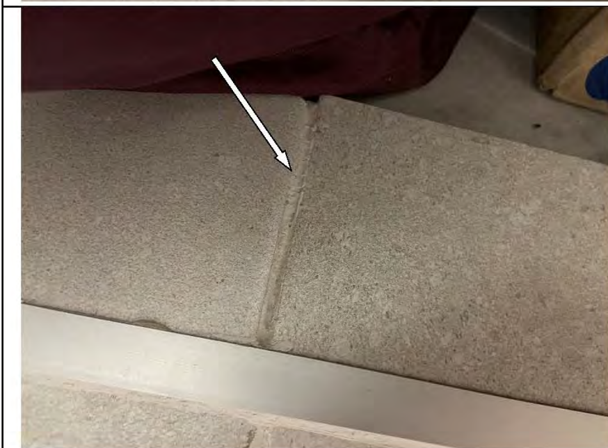
Фото №30. Неровные швы напольной керамической плитки в санузле.
