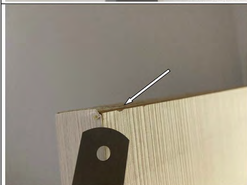
Фото №65. Сколы на полотне деревянного дверного блока в ванной комнате.
