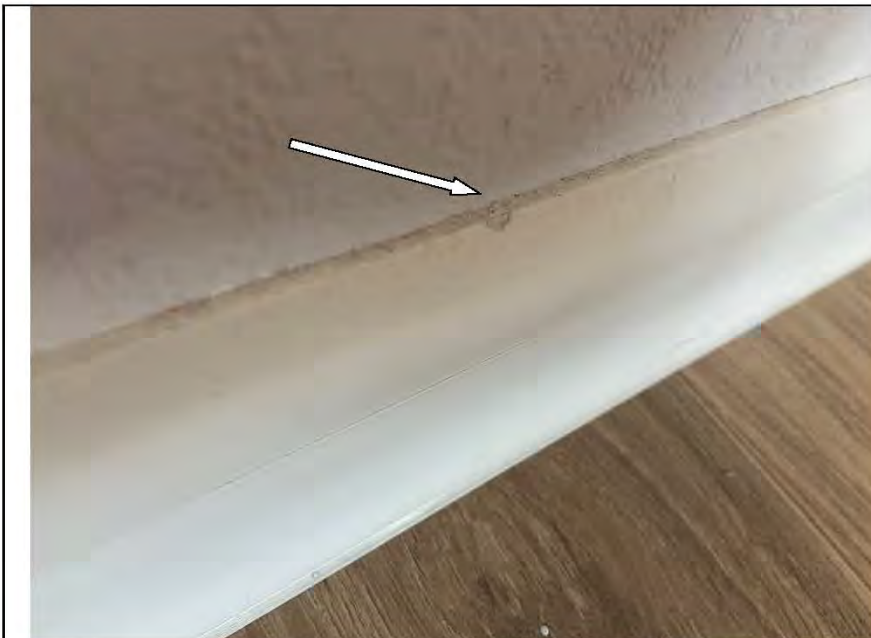
Фото №34. Дефект на напольном плинтусе ПВХ в детской.
