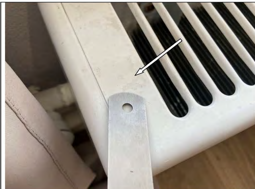
Фото №82. Загрязнения на металлическом кожухе отопительного прибора в кухне.
