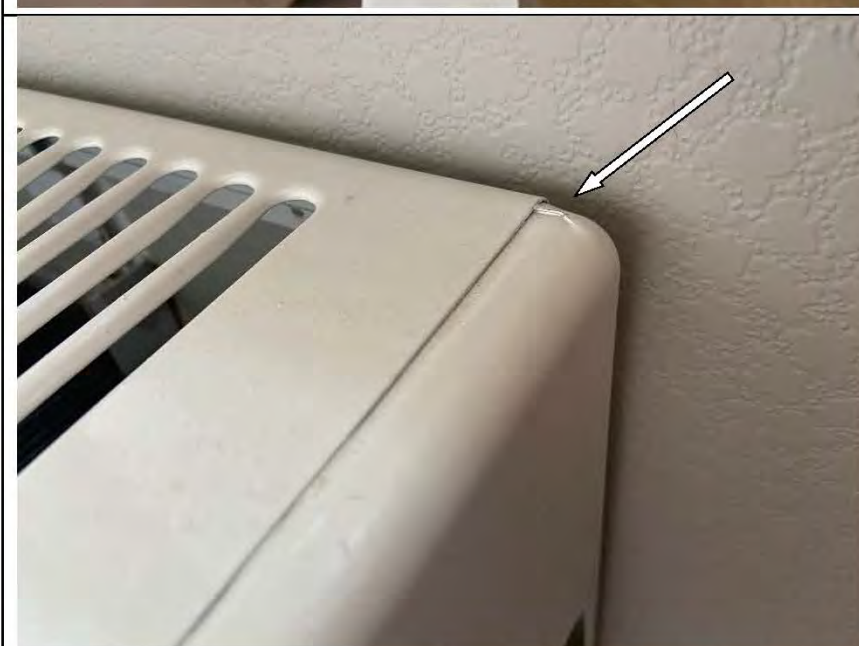
Фото №83. Загиб на металлическом кожухе отопительного прибора в спальне.
