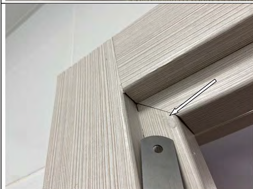
Фото №71. Загрязнения на коробке деревянного дверного блока в ванной комнате.
