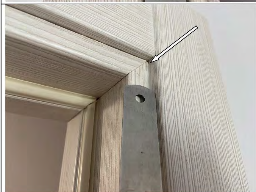
Фото №72. Загрязнения на коробке деревянного дверного блока в детской.
