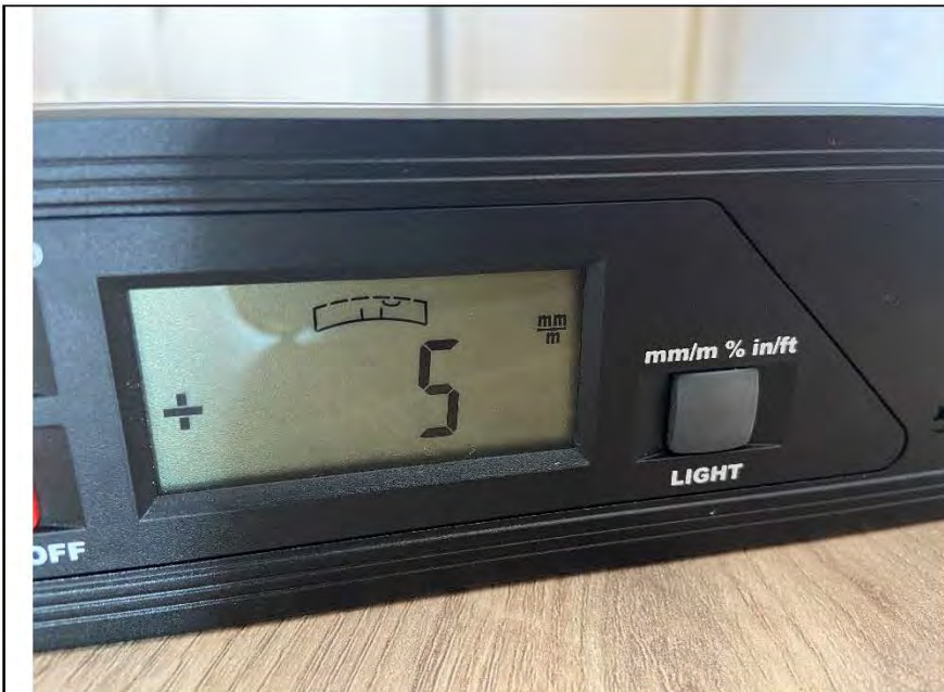
Фото №19. Отклонение напольного покрытия из ламината в детской.
