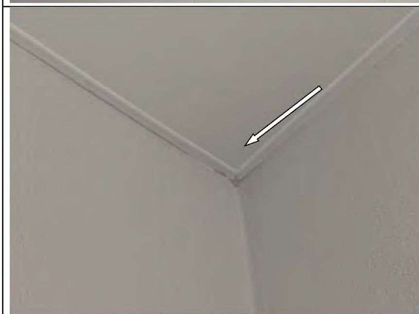
Фото №81. Загрязнения на полотне натяжного потолка в детской.
