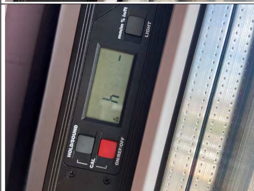
Фото №60. Отклонение по вертикали оконного блока ПВХ в детской.
