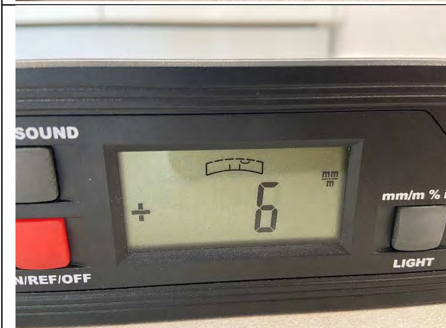
Фото №21. Отклонение напольного покрытия из керамической плитки в кухне.
