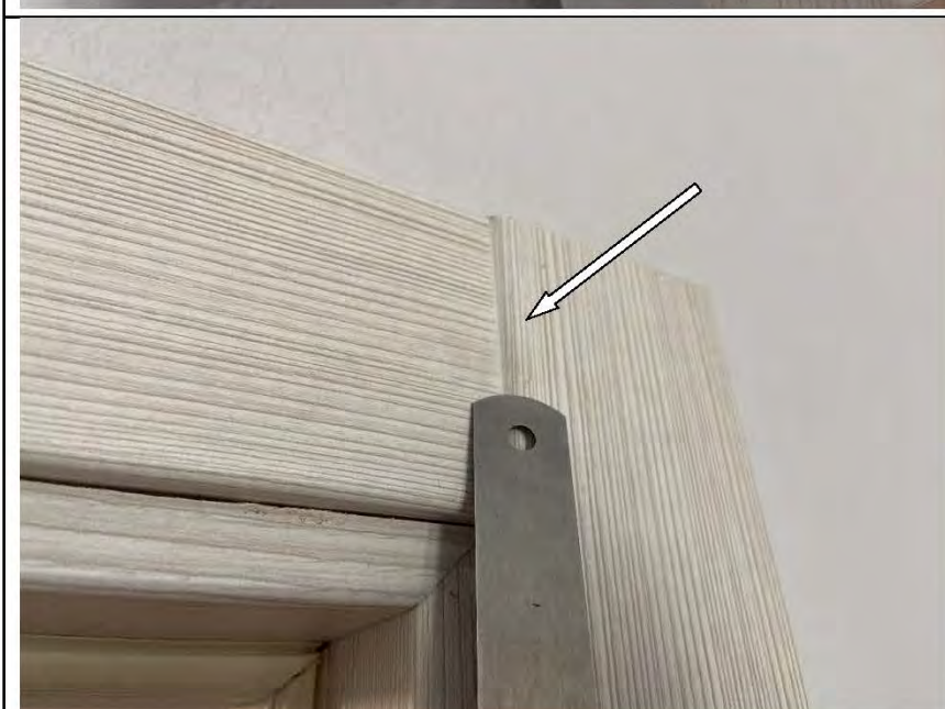
Фото №69. Загрязнения на наличнике деревянного дверного блока в детской.
