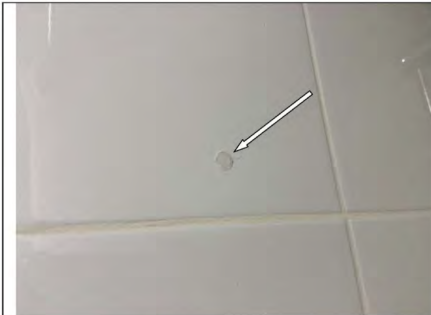
Фото №13. Загрязнения на настенной керамической плитке в санузле.
