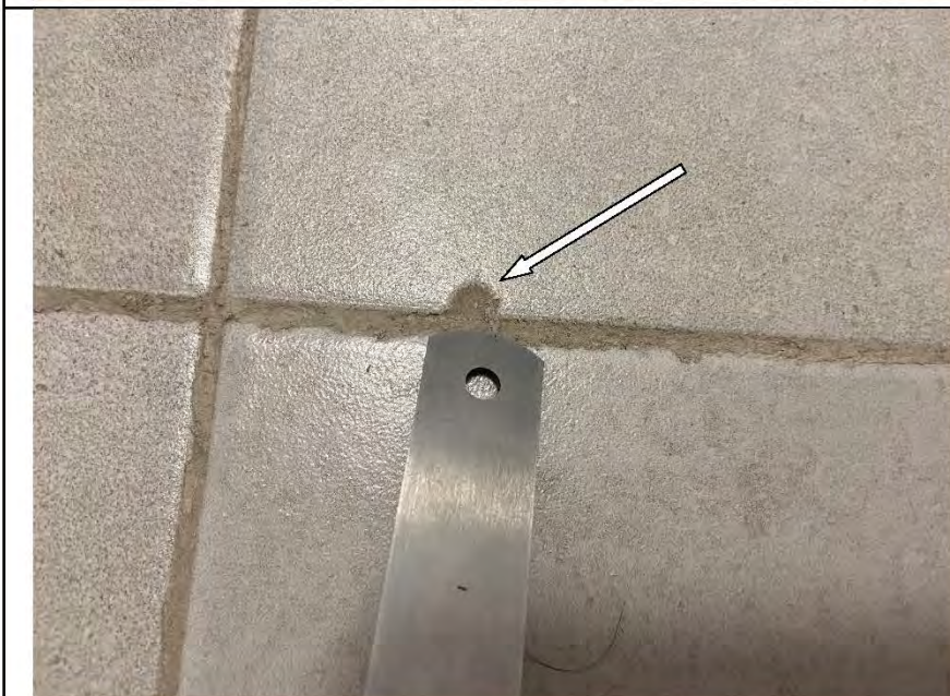
Фото №38. Скол на напольной керамической плитке в ванной комнате.
