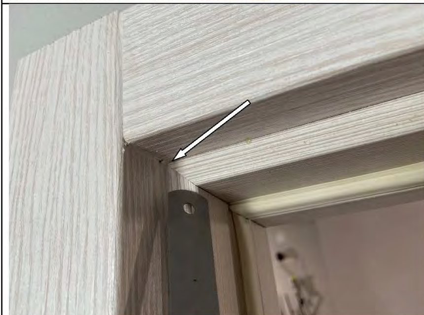
Фото №74. Загрязнения на коробке деревянного дверного блока в спальне.
