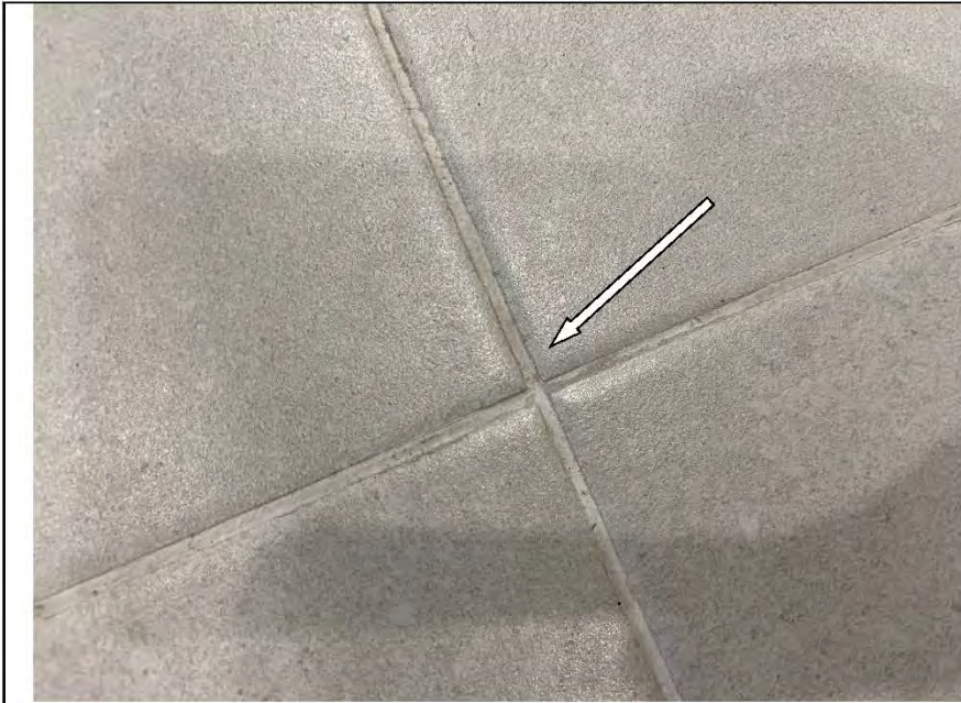
Фото №28. Неровные швы напольной керамической плитки в кухне.
