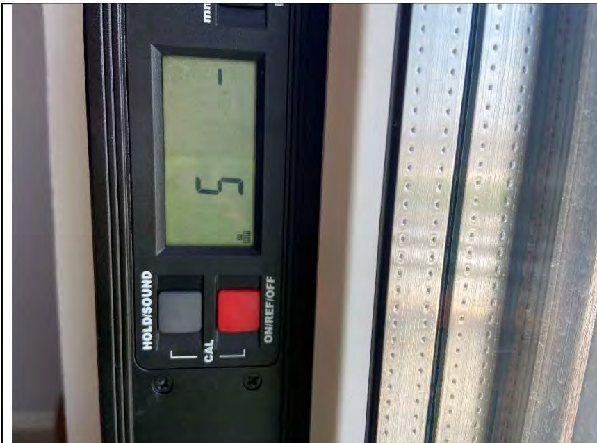
Фото №61. Отклонение по вертикали оконного блока ПВХ в детской.
