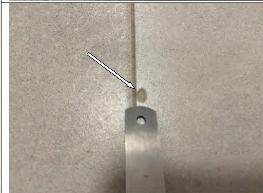
Фото №39. Скол на напольной керамической плитке в ванной комнате.
