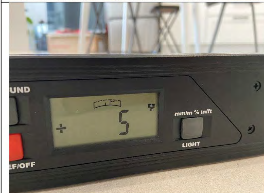
Фото №20. Отклонение напольного покрытия из керамической плитки в коридоре.
