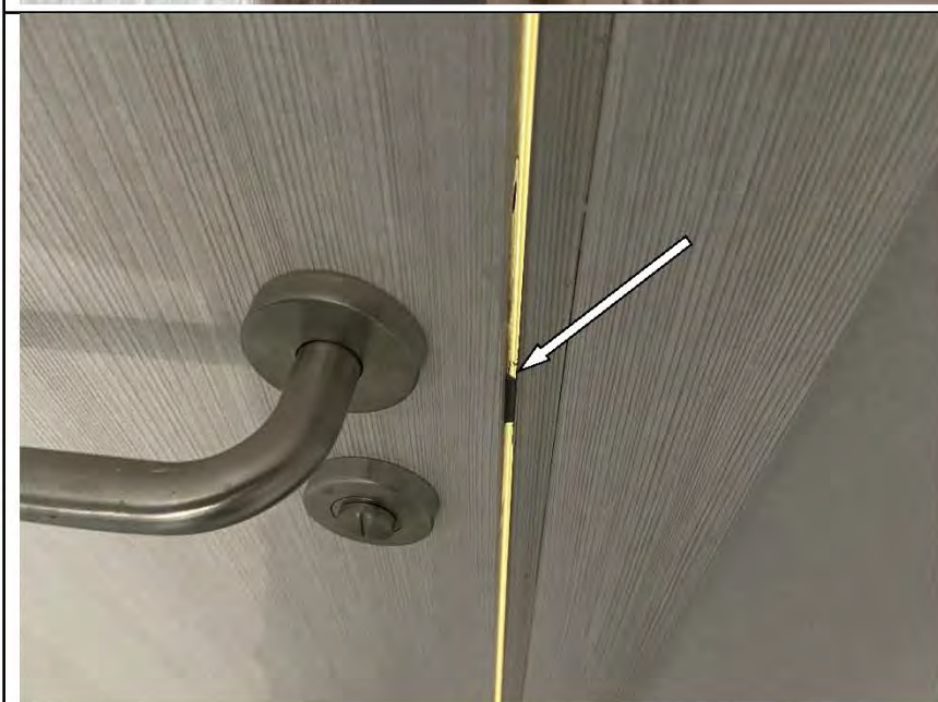
Фото №75. Не закрывается/открывается свободно дверь в ванной комнате.
