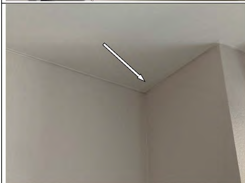
Фото №77. Загрязнения на полотне натяжного потолка в кухне.
