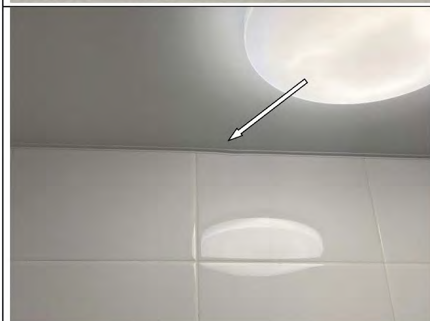
Фото №80. Загрязнения на полотне натяжного потолка в санузле.
