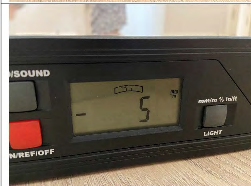
Фото №18. Отклонение напольного покрытия из ламината в спальне.
