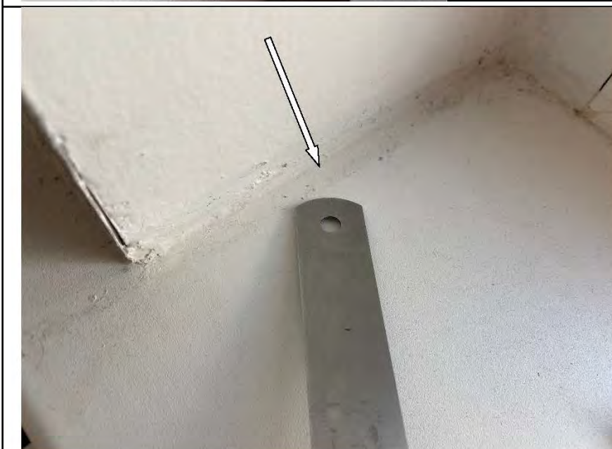
Фото №42. Дефект на лицевой стороне подоконной доски в детской.
