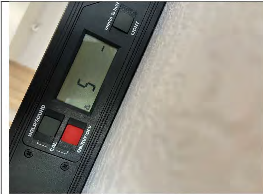
Фото №7. Отклонение поверхности стен от вертикали в кухне.
