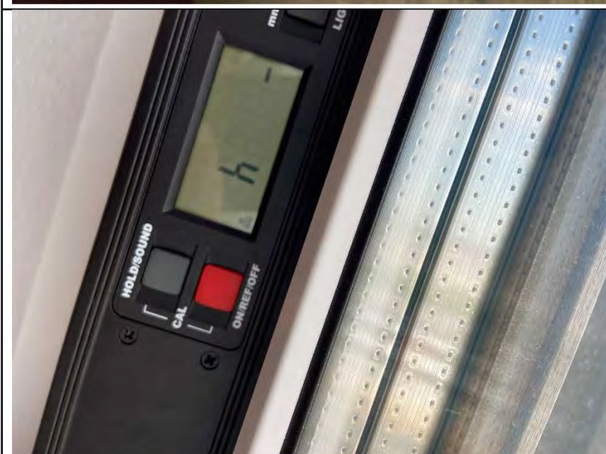
Фото №59. Отклонение по вертикали оконного блока ПВХ в кухне.
