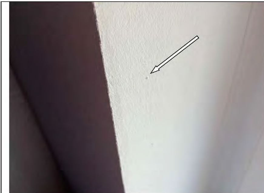
Фото №46. Неровности, выбоины, раковины на окрашенных откосах оконного блока ПВХ в детской.
