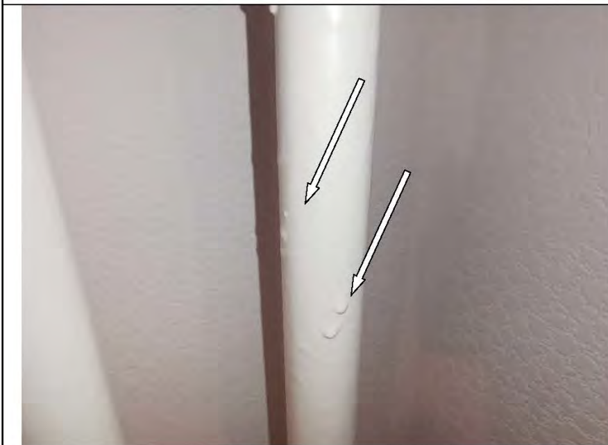
Фото №86. Окрашивание труб отопления выполнено с дефектами в кухне.
