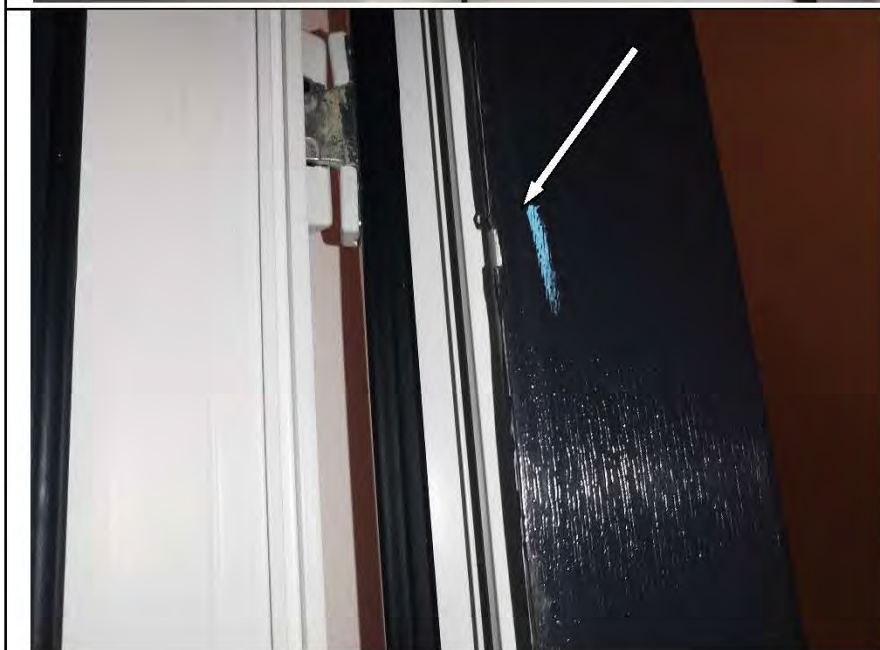
Фото №63. Потертости на профиле ПВХ оконного блока в спальне
