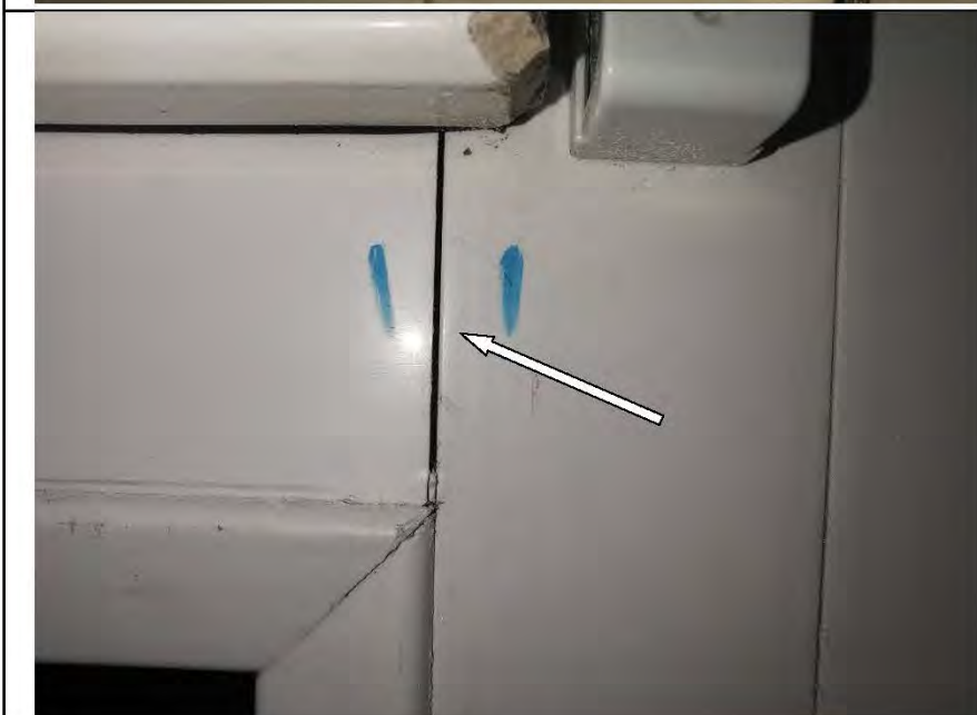
Фото №60. Зазор в месте стыка профилей оконного блока в гостиной.
