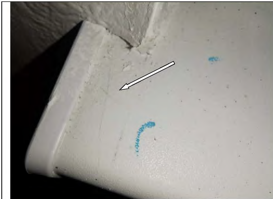
Фото №67. Царапины на лицевой поверхности подоконной доски в кухне.
