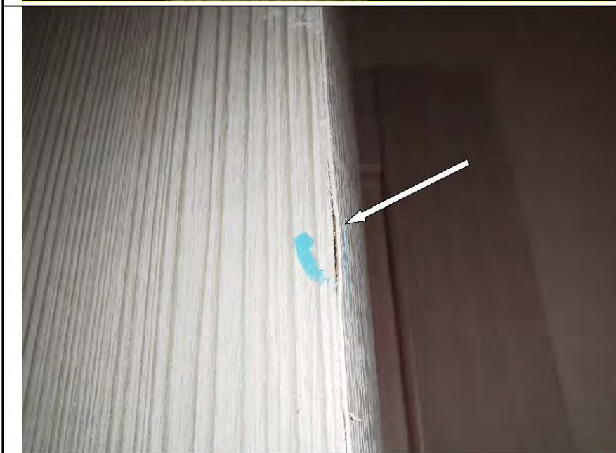
Фото №74. Повреждение ламинации полотна деревянного дверного блока в спальне.
