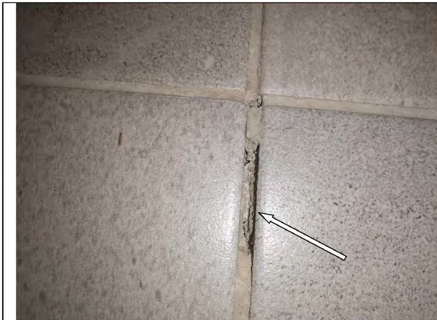
Фото №46. Затирка напольной плитки в ванной комнате выполнена с нарушениями (неполное заполнение шва затирочным составом).
