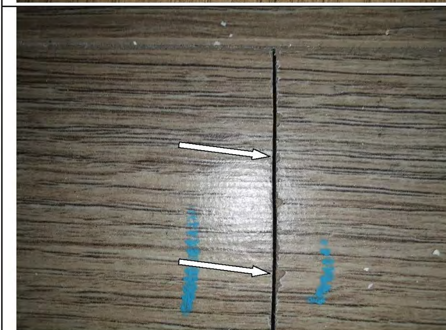
Фото №36. Зазор между соседними досками ламината, сколы на ламинате в спальне.
