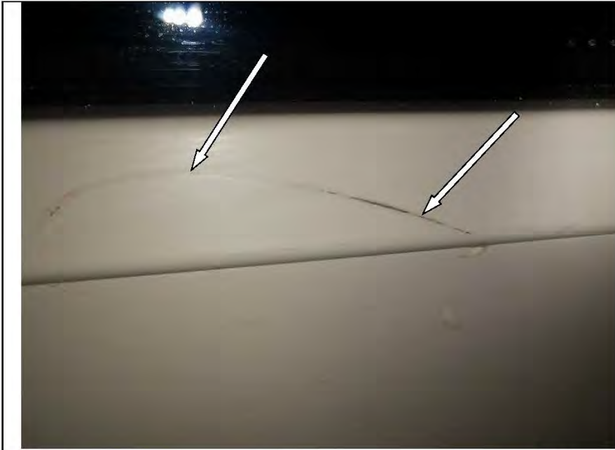
Фото №58. Царапины на профиле ПВХ оконного блока в кухне.
