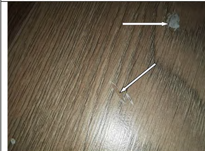
Фото №38. Выбоины и загрязнение ламината в кухне.
