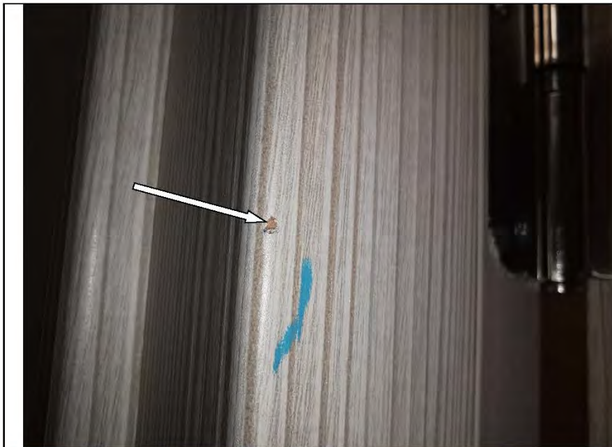
Фото №76. Скол на коробе деревянного дверного блока в ванной комнате.
