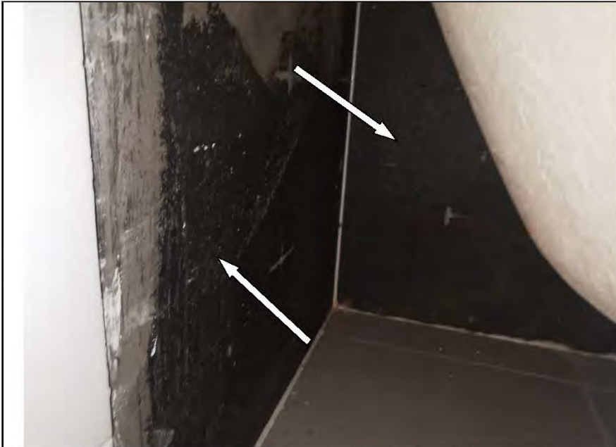
Фото №28. Частично отсутствует настенная керамическая плитка за ванной.
