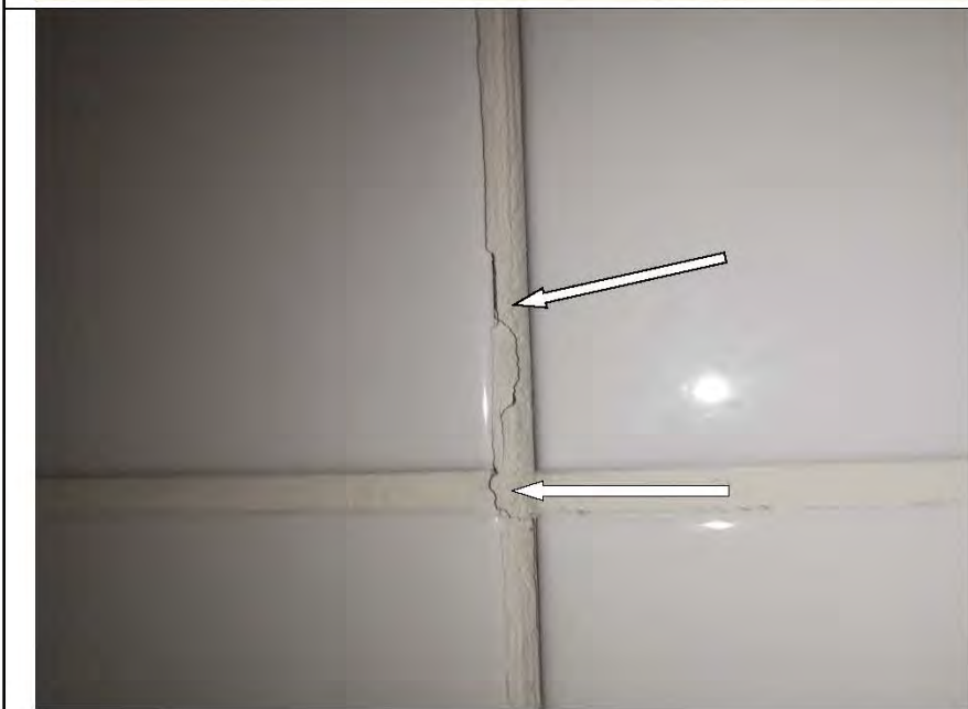
Фото №27. Затирка настенной плитки в ванной комнате выполнена с нарушениями.
