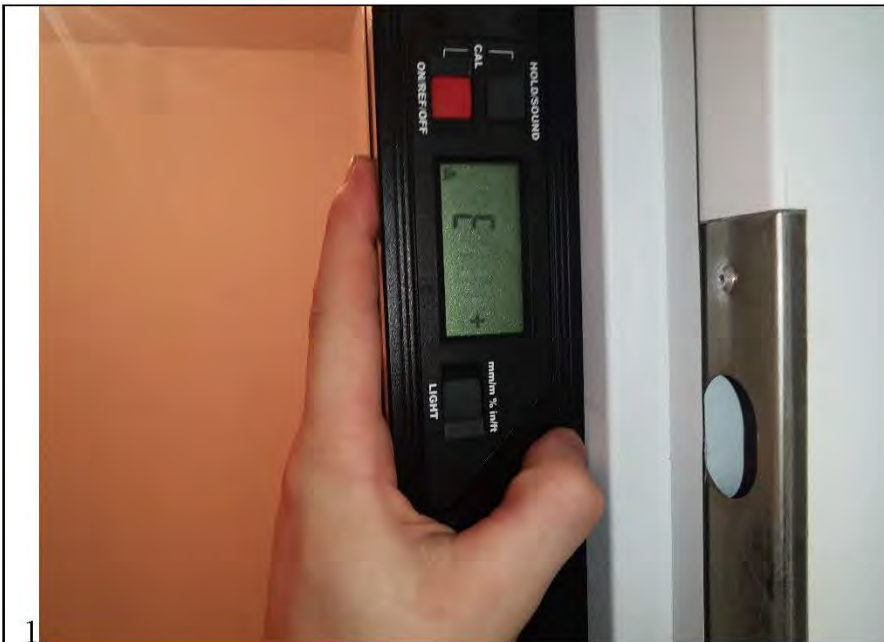
Фото №85. Отклонение входного дверного блока.
