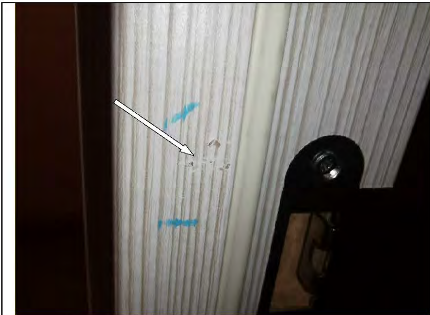
Фото №73. Потертости на коробе деревянного дверного блока в спальне.
