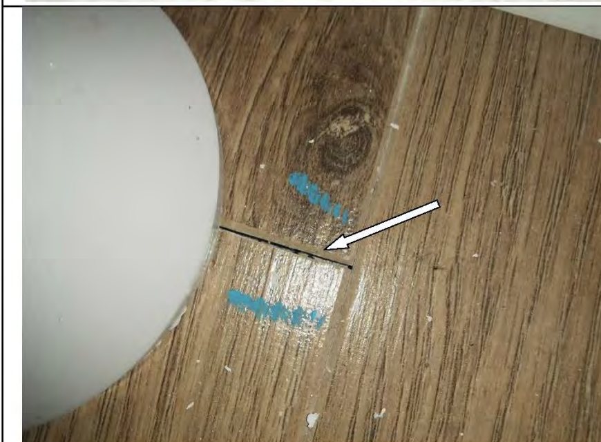
Фото №35. Зазор между соседними досками ламината в гостиной.
