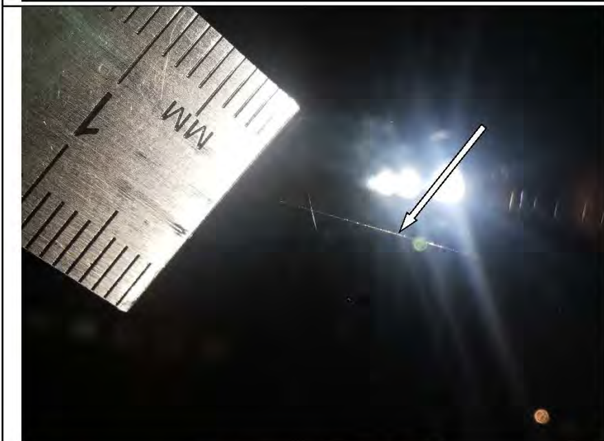
Фото №65. Царапины на стеклопакете оконного блока ПВХ в гостиной.
