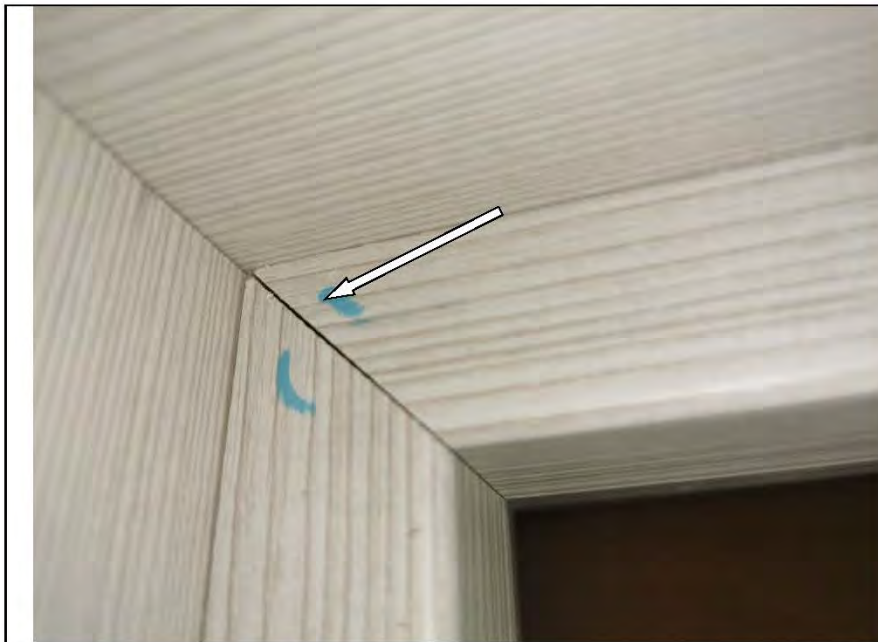
Фото №79. Элементы дверного блока (коробка) соединены не надежно в гостиной.
