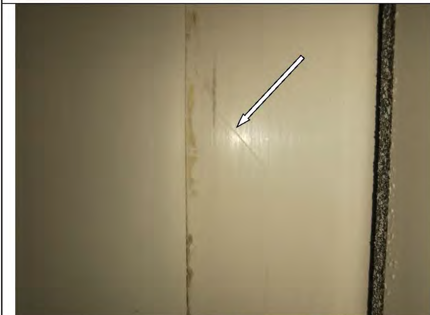
Фото №59. Царапины на профиле ПВХ оконного блока в гостиной.
