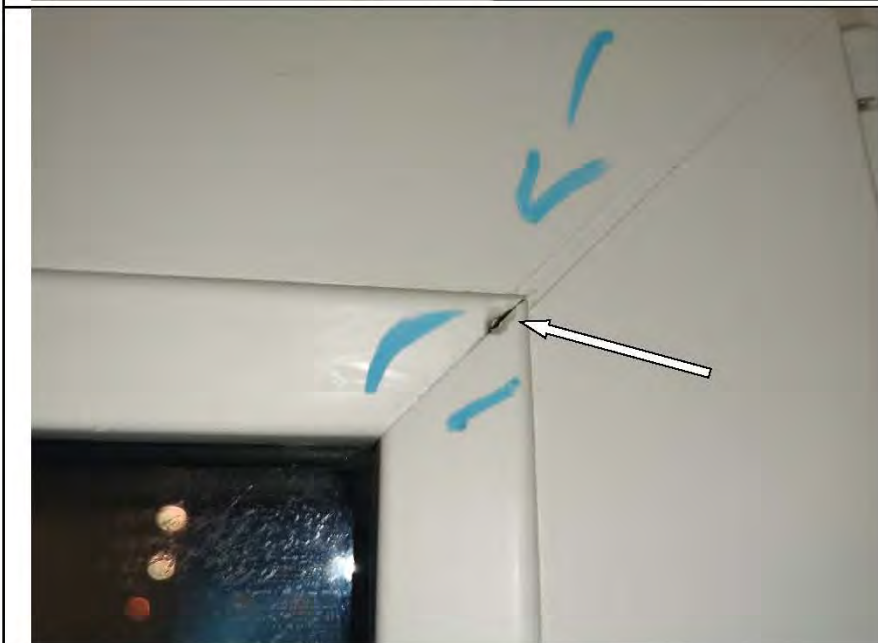
Фото №57. Скол на профиле ПВХ оконного блока в кухне.
