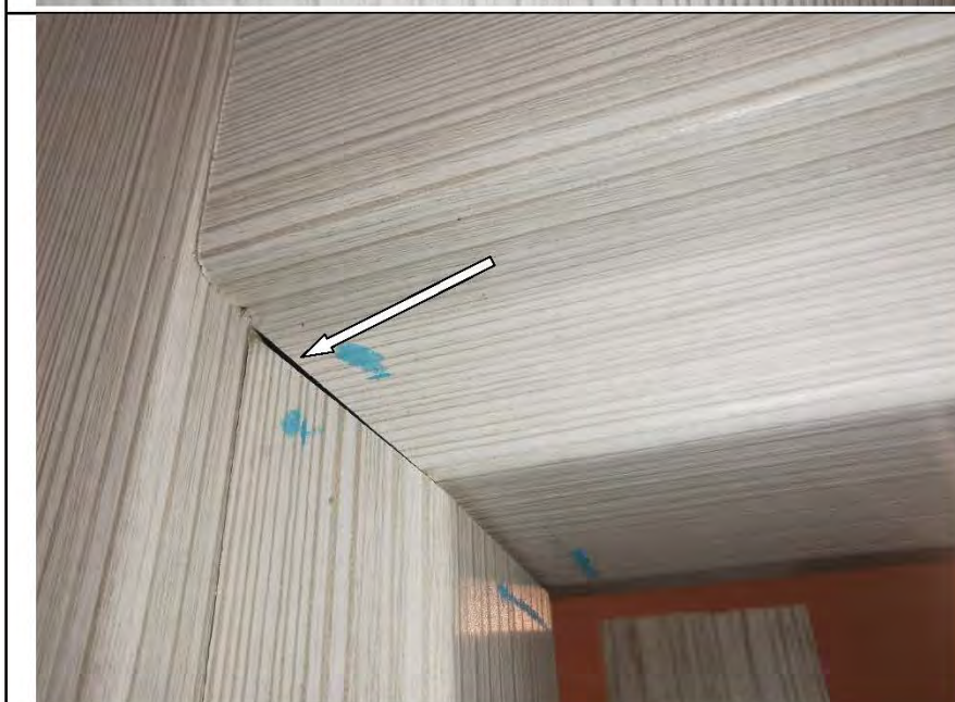
Фото №78. Элементы дверного блока (коробка) соединены не надежно в санузле.
