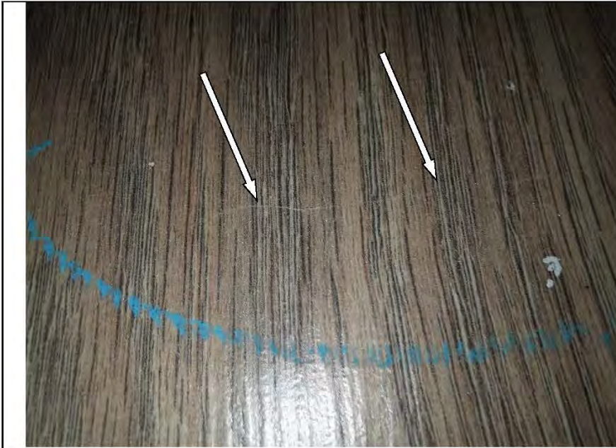
Фото №37. Царапины на ламинате в кухне.
