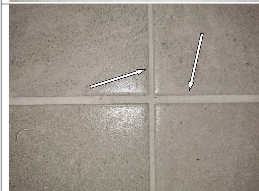
Фото №45. Затирка напольной плитки в санузле выполнена с нарушениями (отклонение ширины шва).
