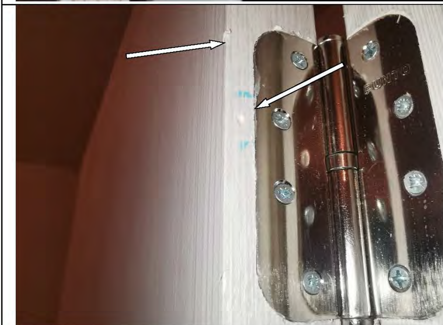
Фото №72. Повреждение ламинации полотна деревянного дверного блока в гостиной.
