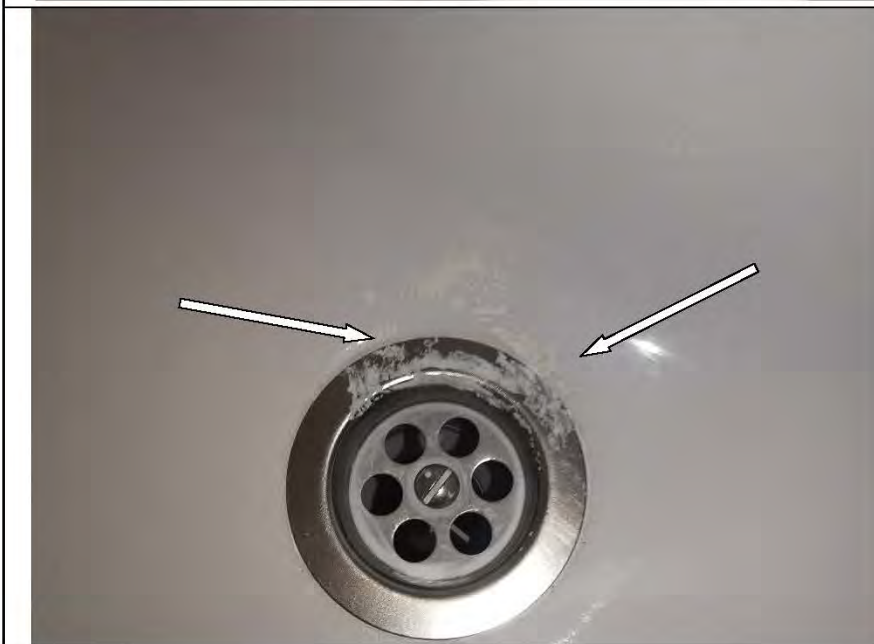
Фото №92. Загрязнение раковины в ванной комнате.
