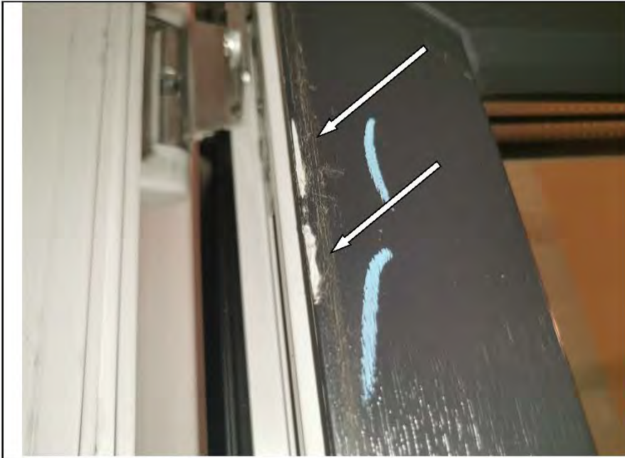
Фото №55. Потертости на профиле ПВХ оконного блока в кухне.
