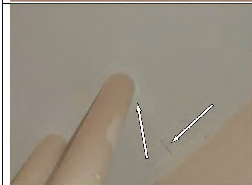
Фото №54. Места прохода труб отопления не закрыты декоративными пластиковыми обводами в спальне.
