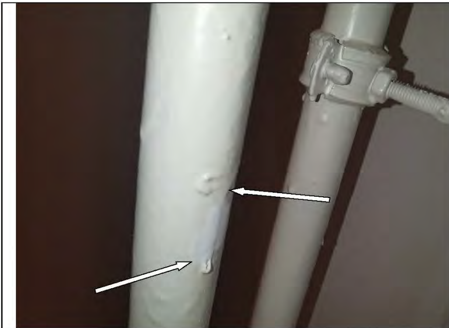
Фото №88. Окрашивание труб отопления выполнено с дефектами в спальне.
