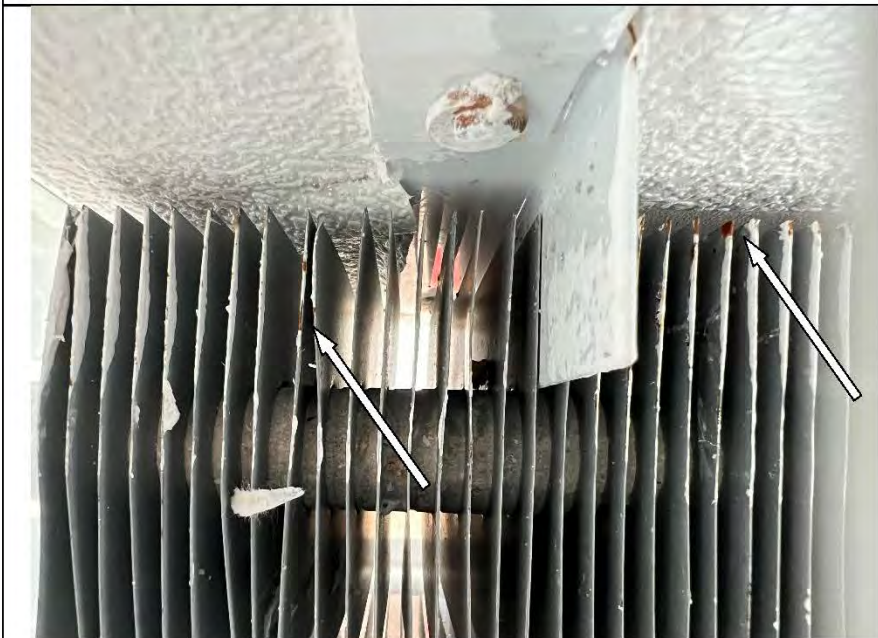
Фото №68. Коррозия и замятие сот радиатора в спальне.
