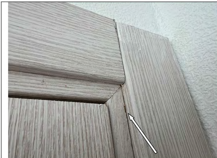
Фото №64. Скол на коробке дверного блока в спальне.
