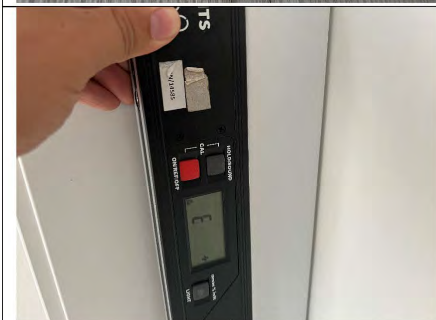
Фото №65. Отклонение коробки входного дверного блока по уровню вертикальности составляет 3 мм.
