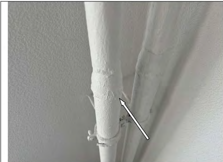
Фото №67. Подтеки краски на трубах отопления в кухне.
