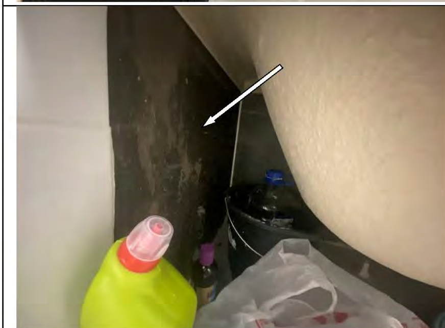
Фото №14. Частично отсутствует настенная керамическая плитка в ванной комнате.
