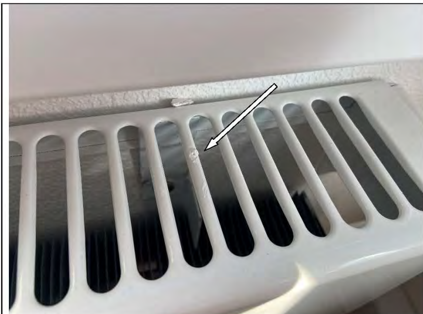
Фото №94. Дефекты на металлическом кожухе отопительного прибора в кухне.
