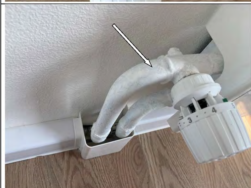
Фото №68. Неровности, подтеки на окрашенных трубах отопления в кухне.
