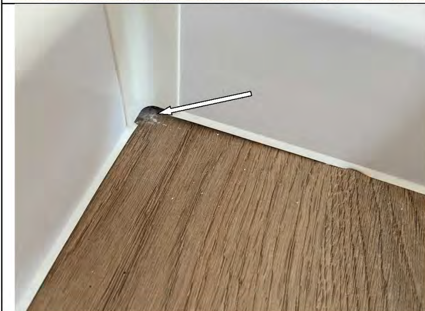
Фото №38. Дефект на напольном покрытии из ламината в кухне.
