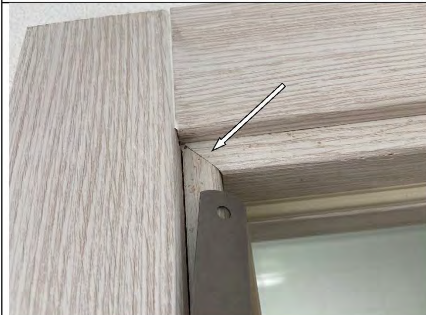
Фото №83. Дефект на коробке деревянного дверного блока в ванной комнате.
