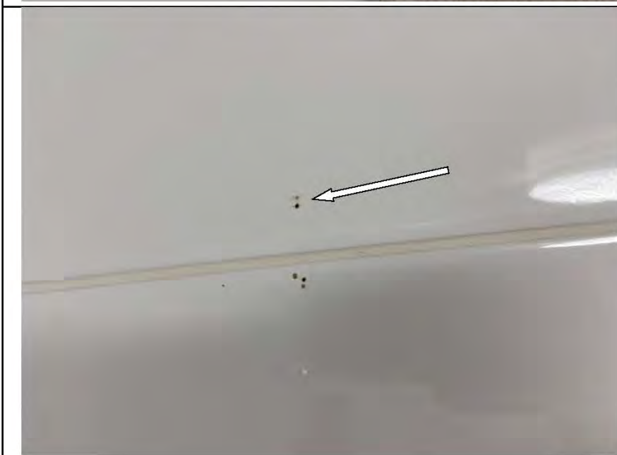
Фото №18. Окалины на настенной керамической плитке в ванной комнате.
