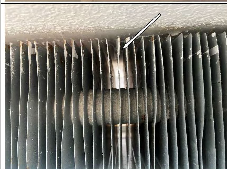
Фото №96. Загиб радиатора в спальне.
