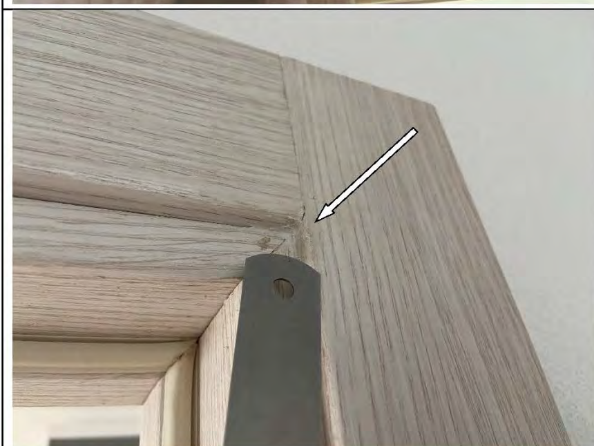
Фото №78. Дефекты на наличниках деревянного дверного блока в спальне.
