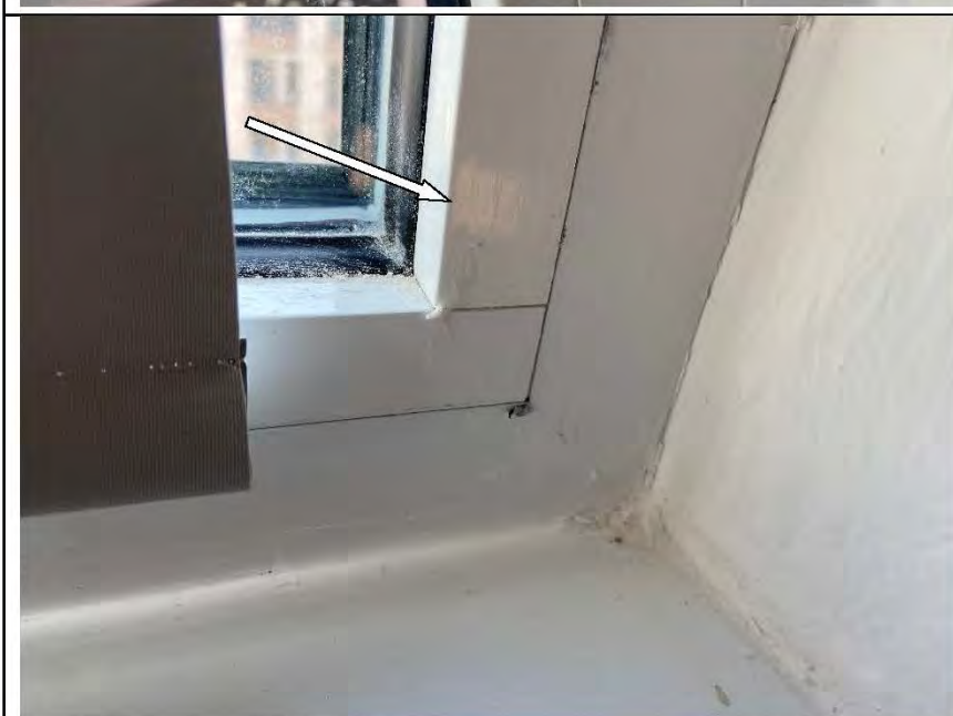
Фото №48. Дефекты на профиле оконного блока ПВХ в кухне.
