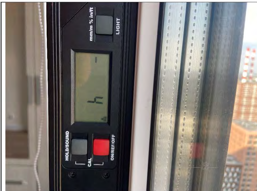
Фото №61. Отклонения от вертикали оконного блока ПВХ в спальне.
