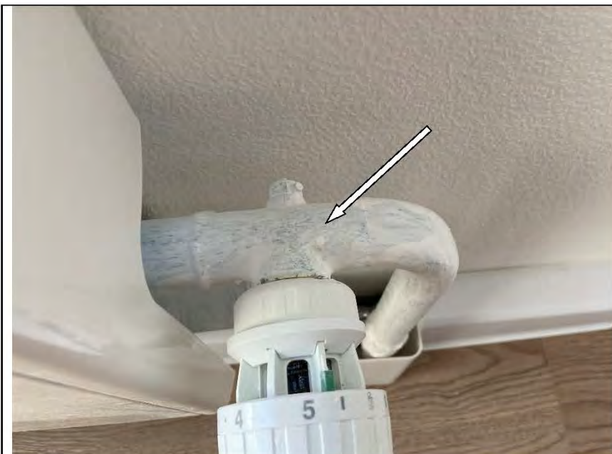
Фото №67. Неровности, подтеки на окрашенных трубах отопления в кухне.
