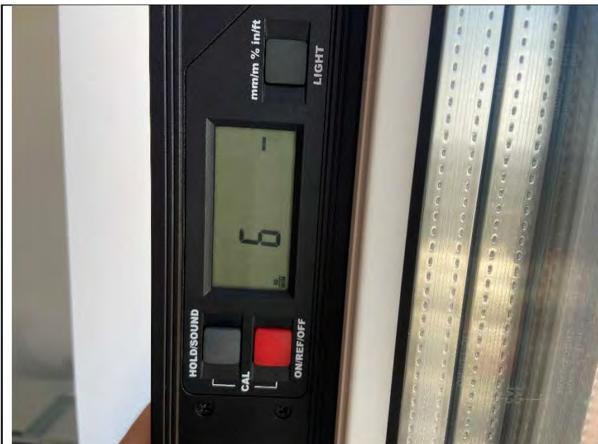
Фото №64. Отклонения от вертикали оконного блока ПВХ в кухне.
