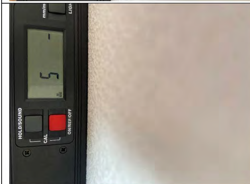
Фото №11. Отклонение поверхности стен от вертикали в кухне.
