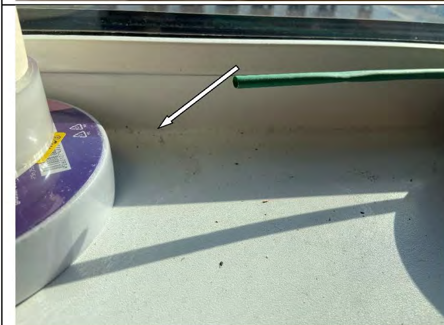
Фото №45. Дефекты на лицевой стороне подоконной доски в кабинете.
