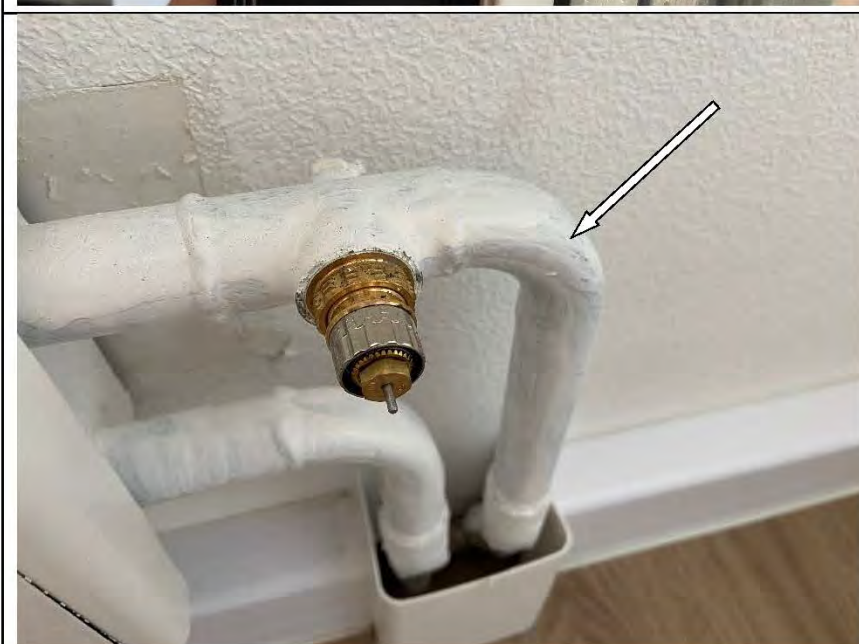
Фото №65. Неровности, подтеки на окрашенных трубах отопления в спальне.
