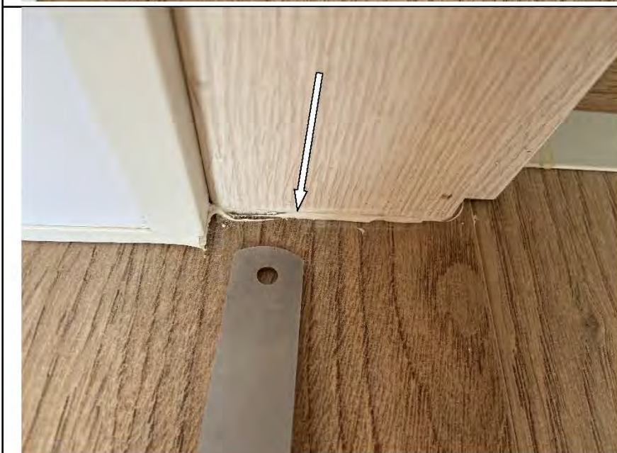
Фото №39. Дефект на напольном покрытии из ламината в кабинете.
