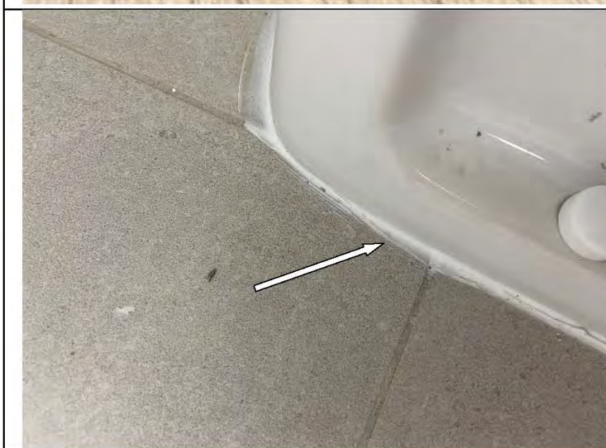
Фото №27. Загрязнения на напольной керамической плитке в санузле.
