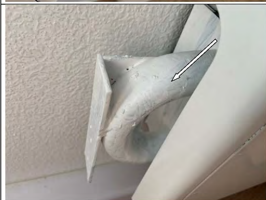
Фото №66. Неровности, подтеки на окрашенных трубах отопления в кухне.
