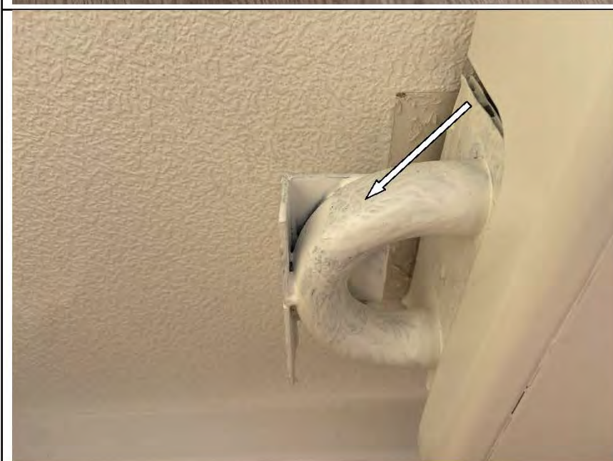
Фото №69. Неровности, подтеки на окрашенных трубах отопления в кабинете.
