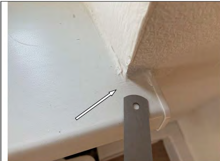
Фото №43. Дефекты на лицевой стороне подоконной доски в кухне.
