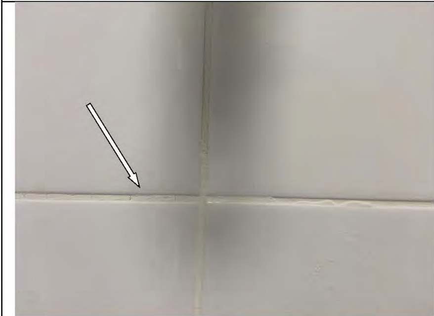
Фото №20. Неровные швы настенной керамической плитки в ванной комнате.
