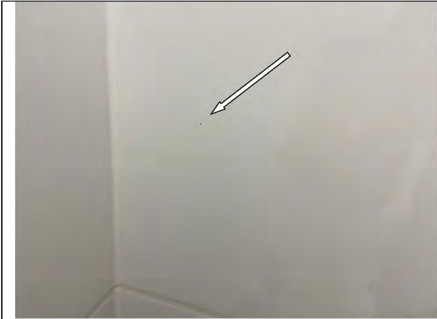
Фото №16. Окалины на настенной керамической плитке в санузле.
