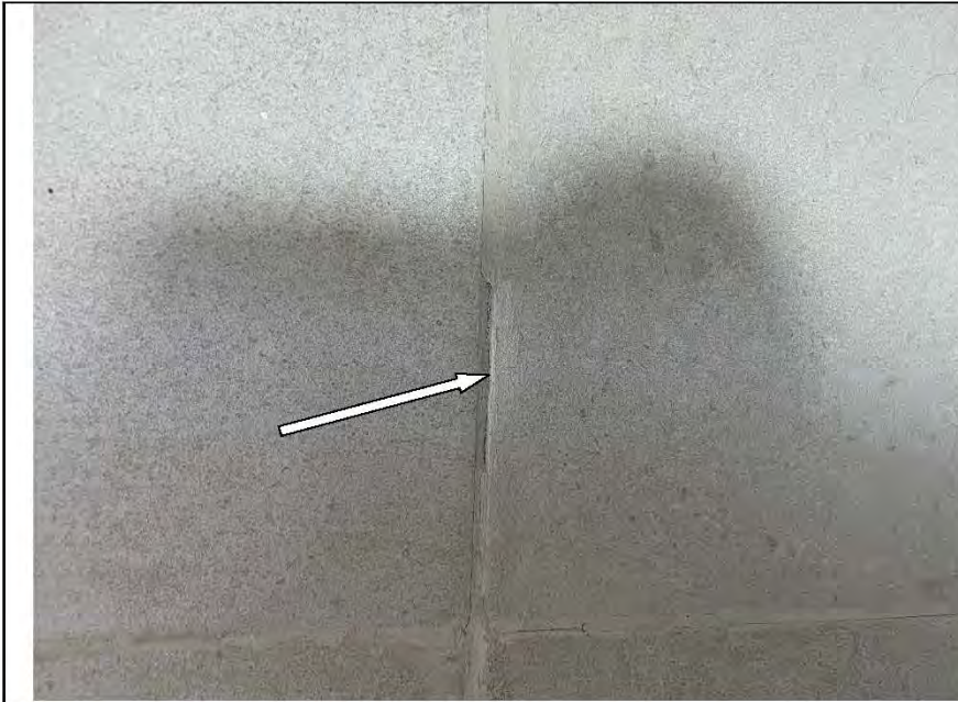
Фото №28. Загрязнения на напольной керамической плитке в ванной комнате.
