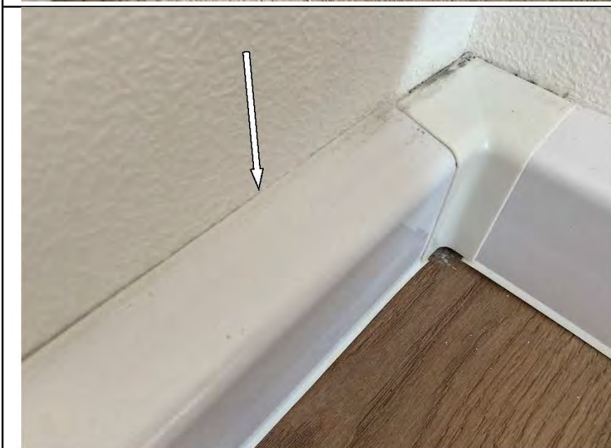
Фото №33. Дефект на напольном плинтусе ПВХ в кухне.
