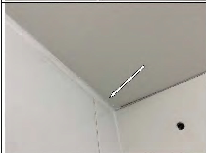
Фото №89. Дефект на поверхности подвесного потолка в санузле.
