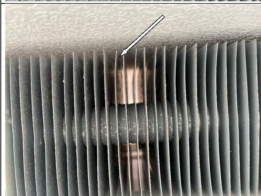
Фото №99. Загиб радиатора в кухне.
