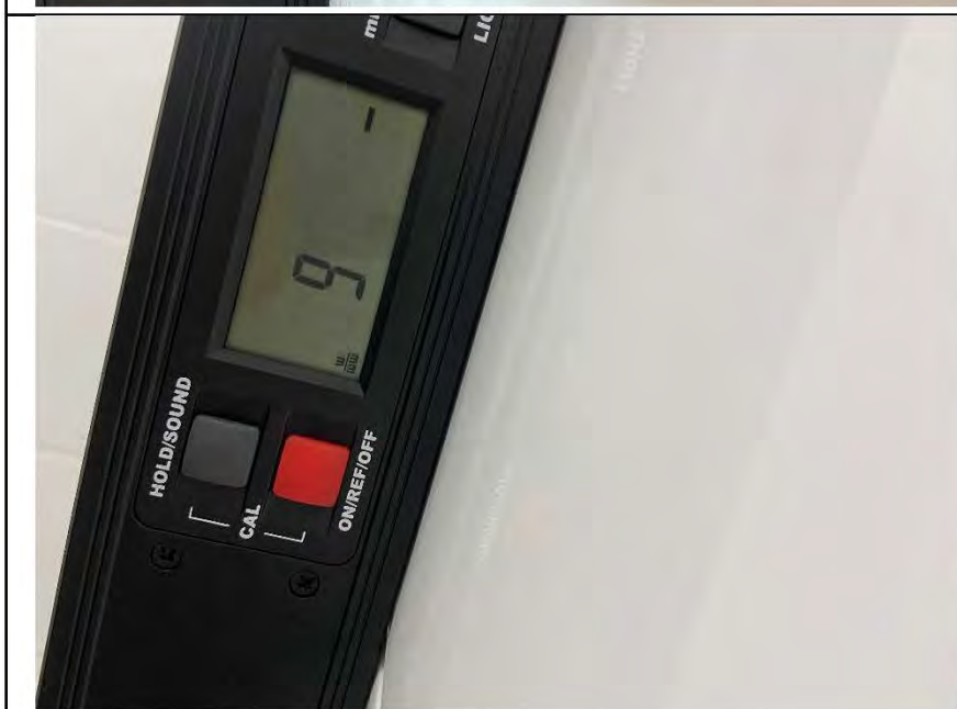
Фото №12. Отклонение поверхности стен от вертикали в санузле.
