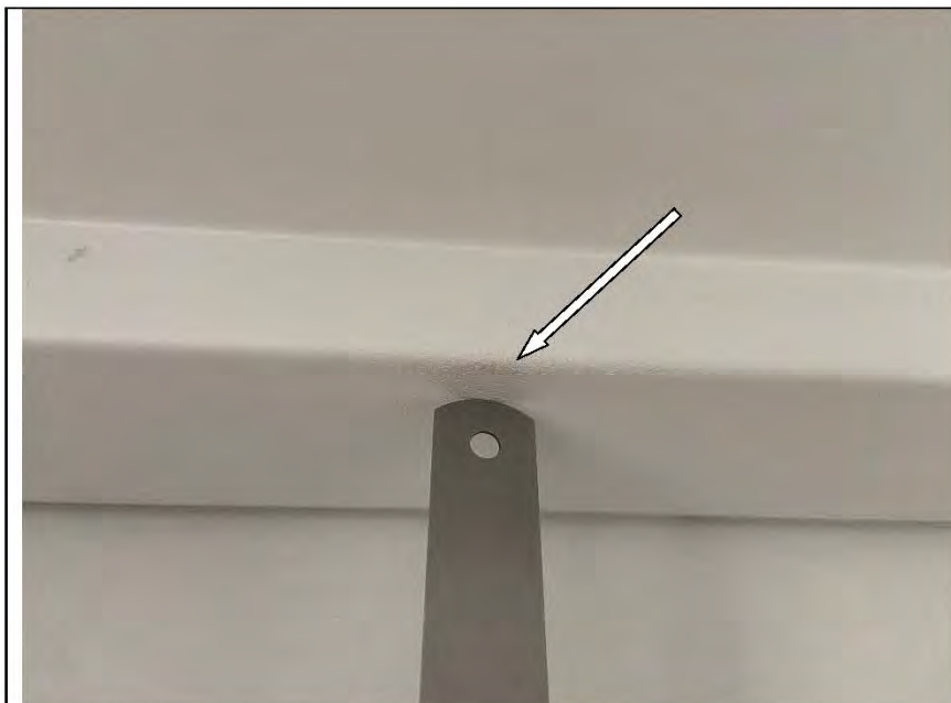
Фото №70. Дефекты на коробке входного дверного блока в коридоре.
