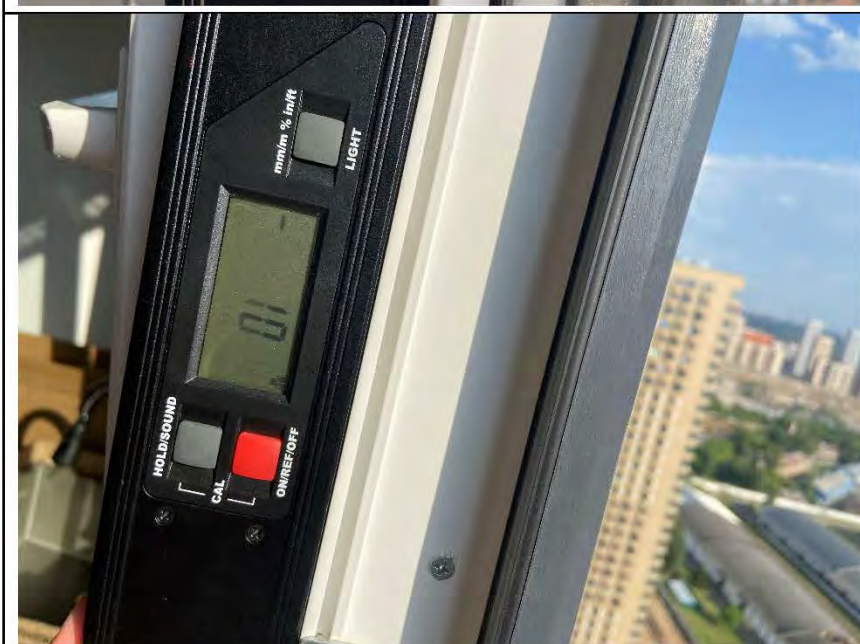
Фото №62. Отклонения от вертикали оконного блока ПВХ в кабинете.
