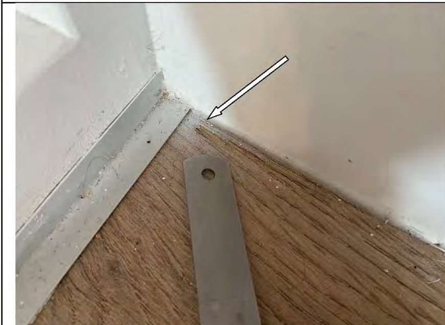
Фото №35. Дефект на напольном покрытии из ламината в коридоре.
