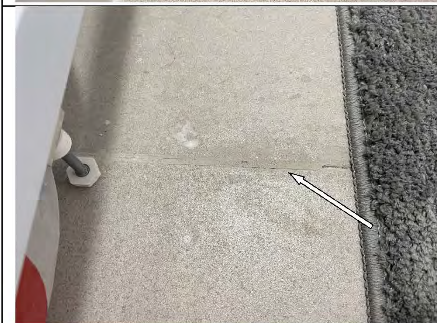
Фото №30. Неровные швы напольной керамической плитки в ванной комнате.
