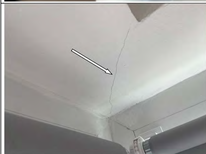
Фото №57. Неровности, выбоины, раковины на окрашенных откосах оконного блока ПВХ в кухне.
