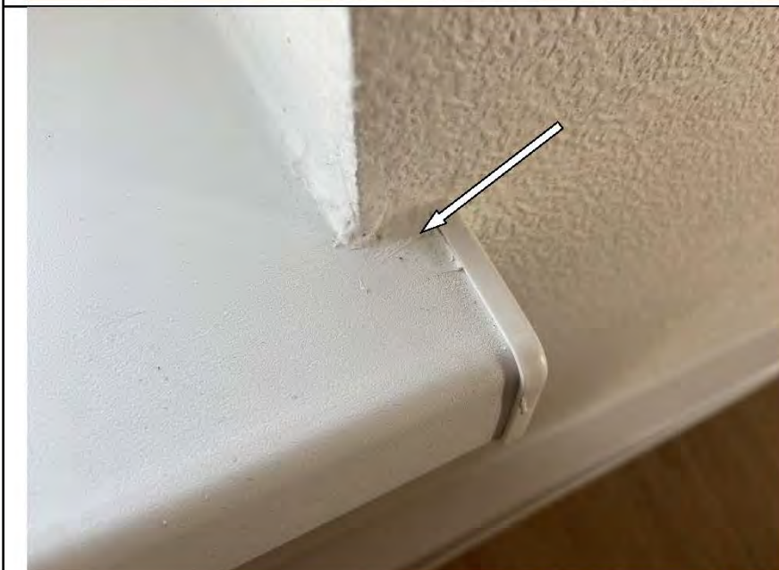
Фото №44. Дефекты на лицевой стороне подоконной доски в кухне.
