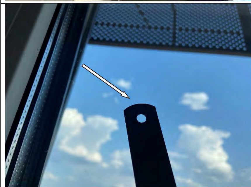
Фото №51. Царапина на стеклопакете оконного блока ПВХ в спальне.
