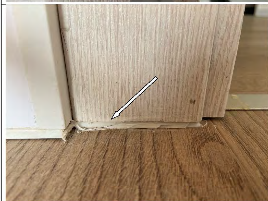
Фото №80. Дефекты на наличниках деревянного дверного блока в кабинете.
