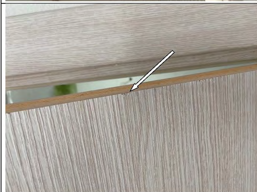
Фото №74. Дефект на полотне деревянного дверного блока в ванной комнате.
