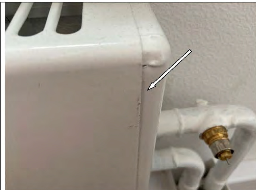
Фото №91. Дефекты на металлическом кожухе отопительного прибора в спальне.
