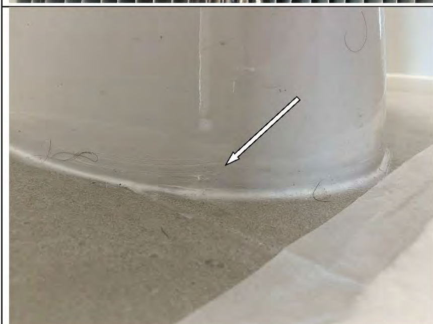
Фото №101. Загрязнения на раковине в санузле.
