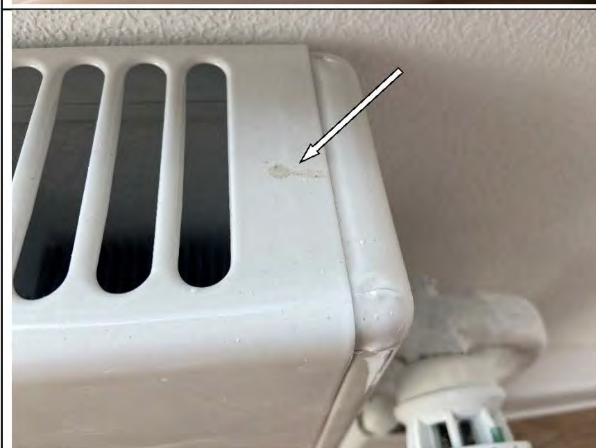
Фото №93. Дефекты на металлическом кожухе отопительного прибора в кухне.
