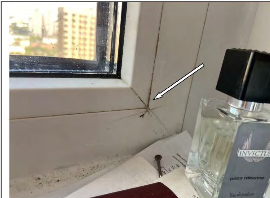
Фото №46. Дефекты на профиле оконного блока ПВХ в спальне.
