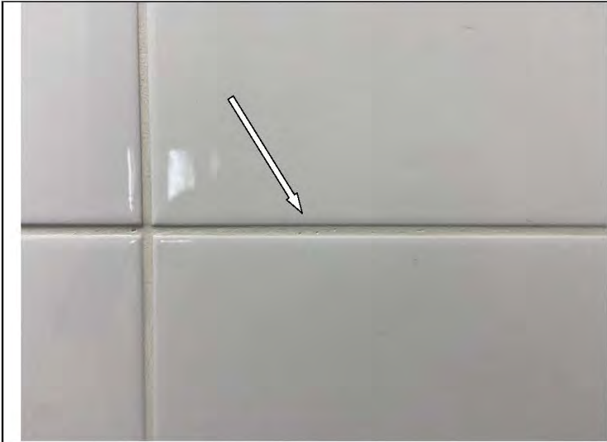
Фото №19. Неровные швы настенной керамической плитки в санузле.
