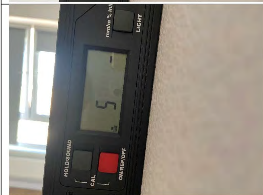
Фото №9. Отклонение поверхности стен от вертикали в спальне.
