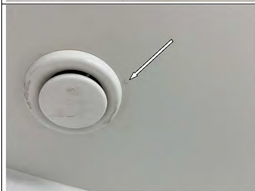
Фото №90. Дефект на поверхности подвесного потолка в ванной комнате.
