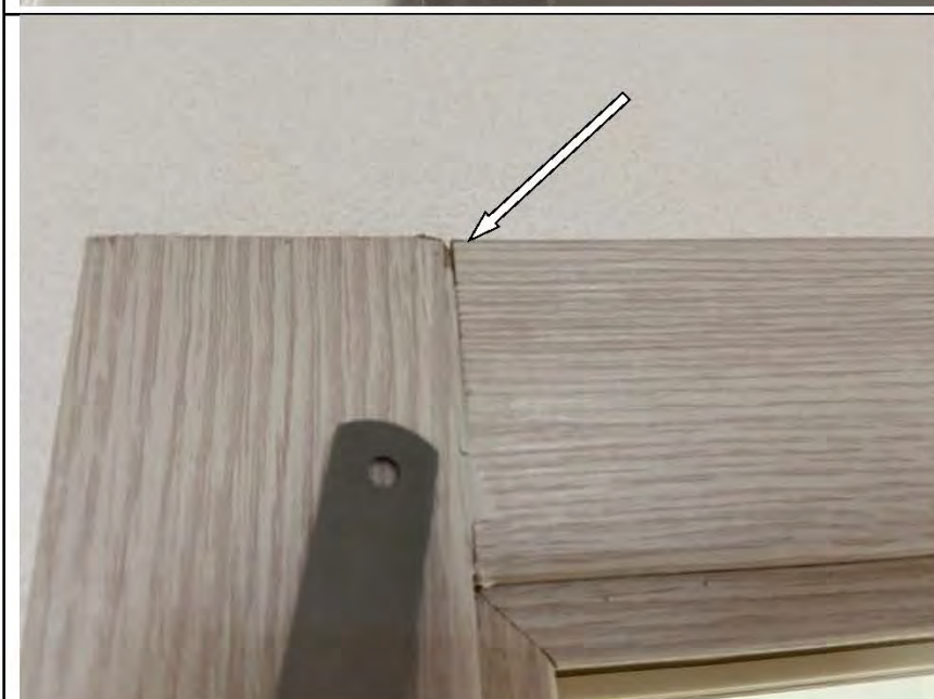
Фото №77. Дефекты на наличниках деревянного дверного блока в санузле.
