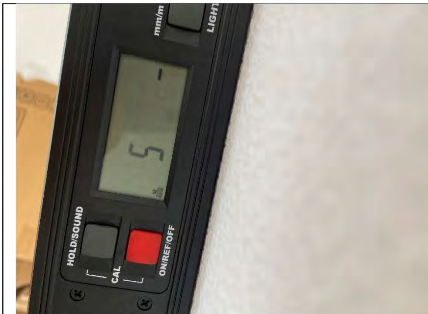
Фото №10. Отклонение поверхности стен от вертикали в кабинете.
