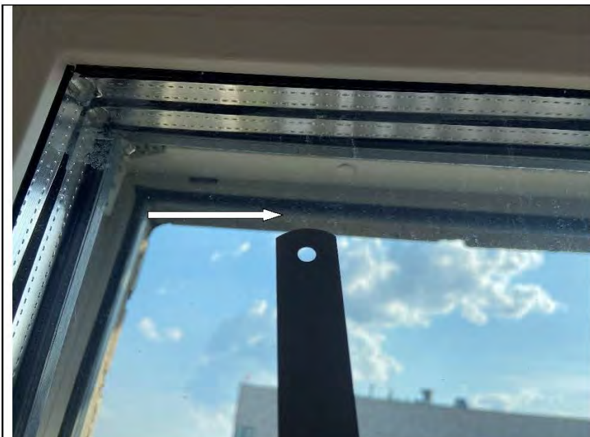
Фото №55. Царапина на стеклопакете оконного блока ПВХ в кабинете.
