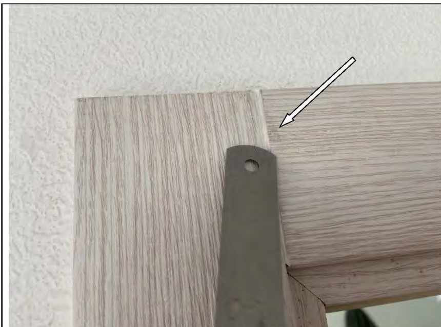
Фото №79. Дефекты на наличниках деревянного дверного блока в ванной комнате.
