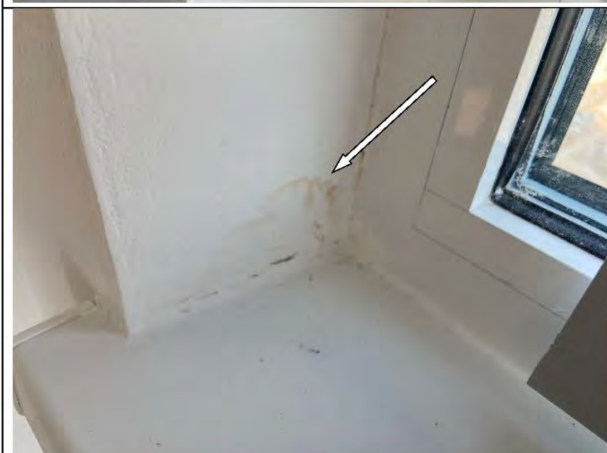
Фото №59. Следы залития на окрашенных откосах оконного блока ПВХ в кухне.
