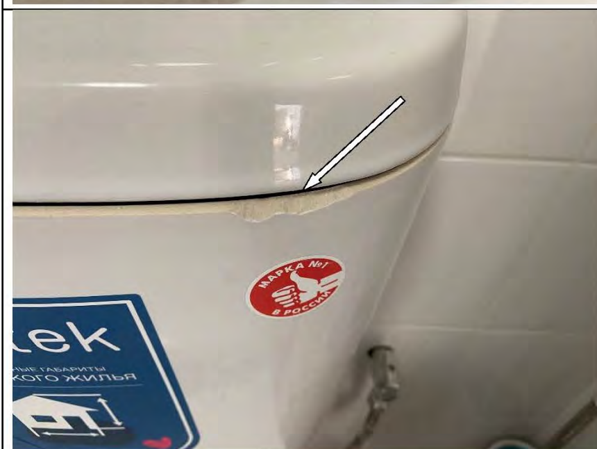
Фото №102. Скол на бачке унитаза в ванной комнате.
