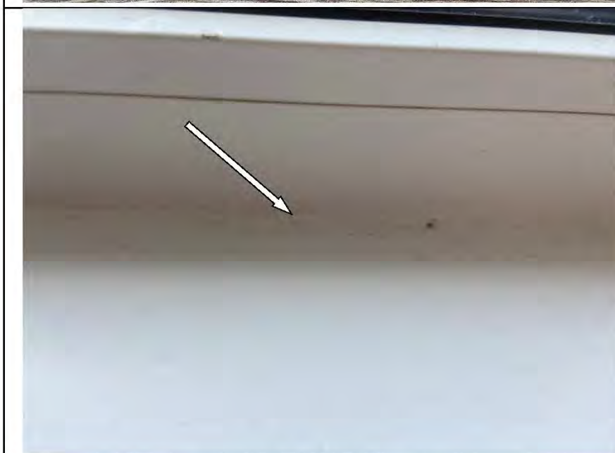
Фото №41. Дефекты на лицевой стороне подоконной доски в спальне.
