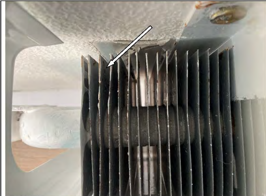
Фото №97. Загиб радиатора в кухне.
