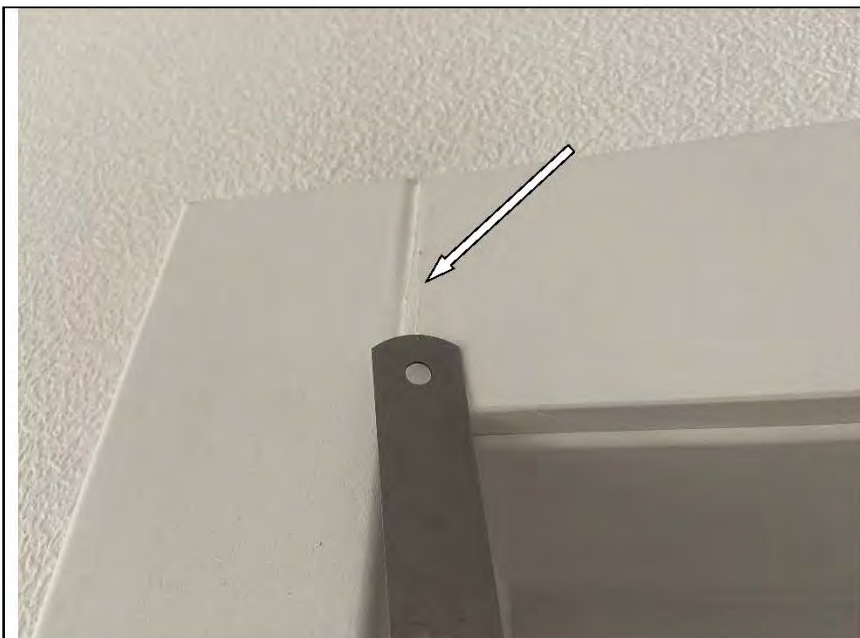
Фото №76. Дефект на наличниках входного дверного блока в коридоре.
