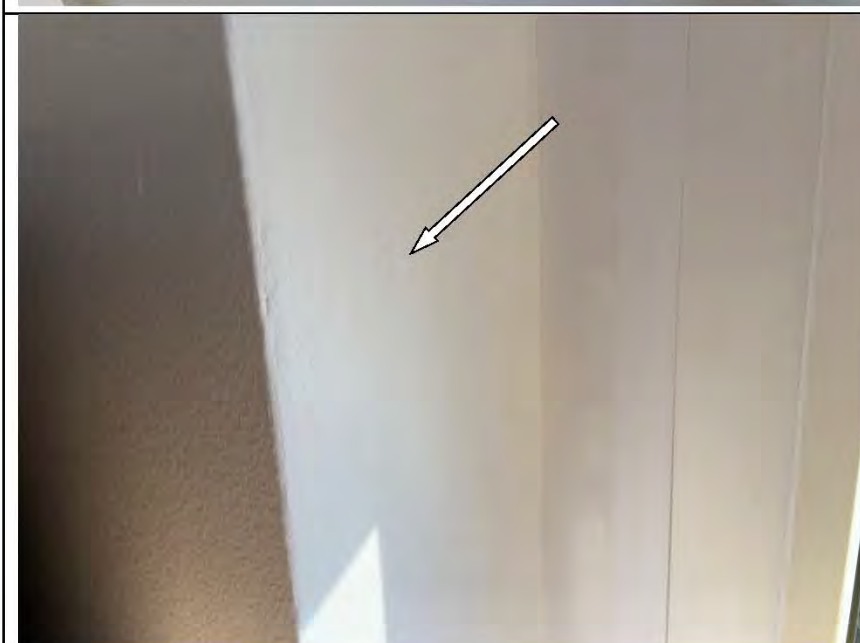
Фото №60. Неровности, выбоины, раковины на окрашенных откосах оконного блока ПВХ в кабинете.
