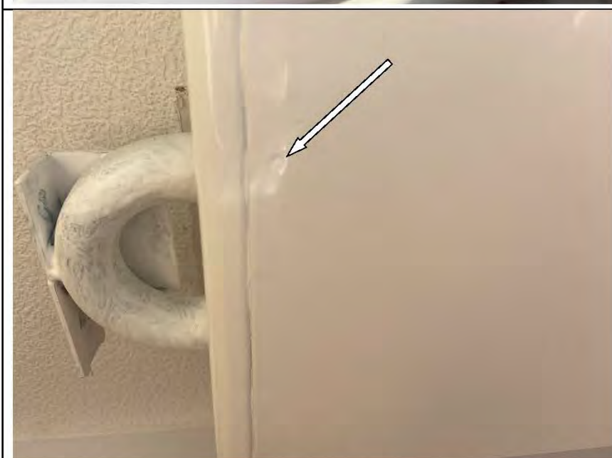
Фото №95. Дефекты на металлическом кожухе отопительного прибора в кабинете.
