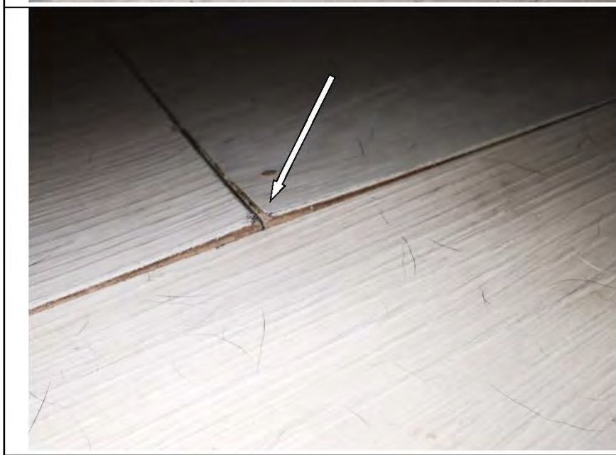
Фото №6. Следы заливия на ламинате.
