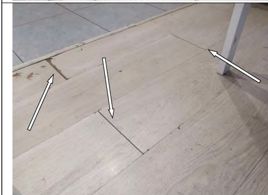
Фото №5. Следы заливия на ламинате.
