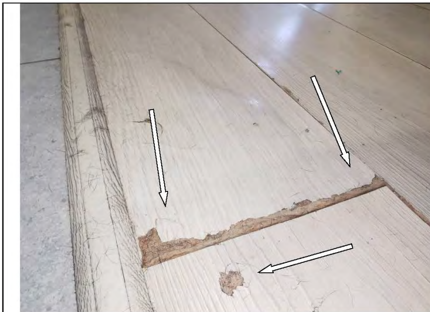
Фото №4. Следы заливия на ламинате.
