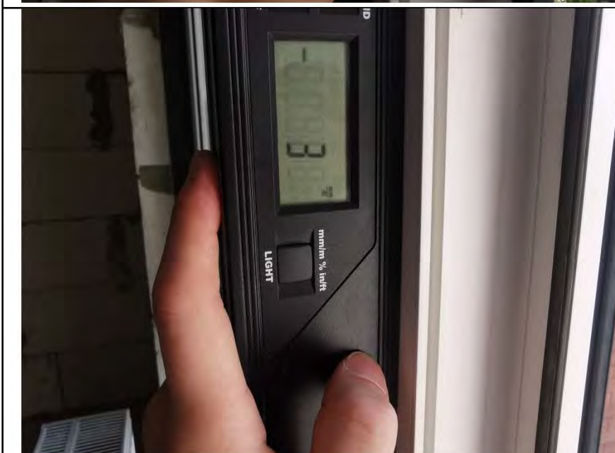
Фото №41. Отклонение балконного блока ПВХ по уровню вертикальности.
