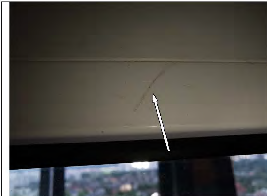
Фото №25. Царапины на профиле ПВХ балконного блока.
