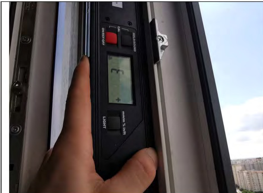
Фото №40. Отклонение оконного блока ПВХ по уровню вертикальности.
