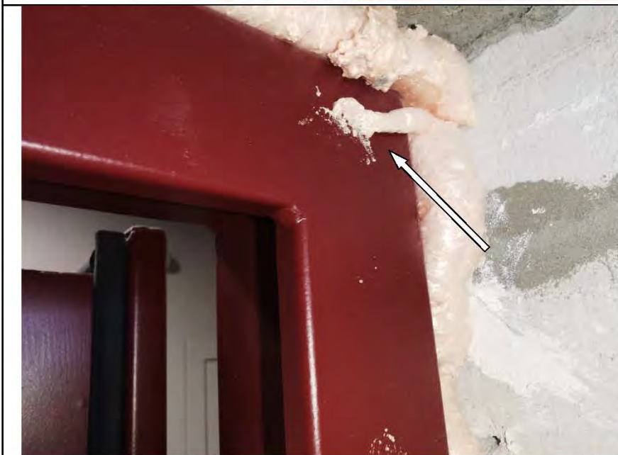
Фото №47. Загрязнения на коробе входного дверного блока.
