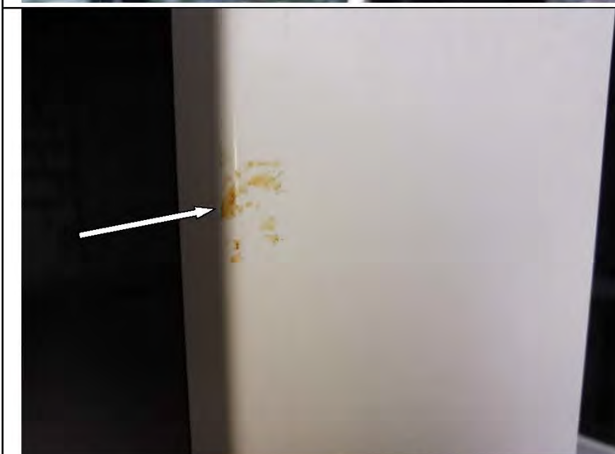
Фото №26. Загрязнения на профиле ПВХ балконного блока.
