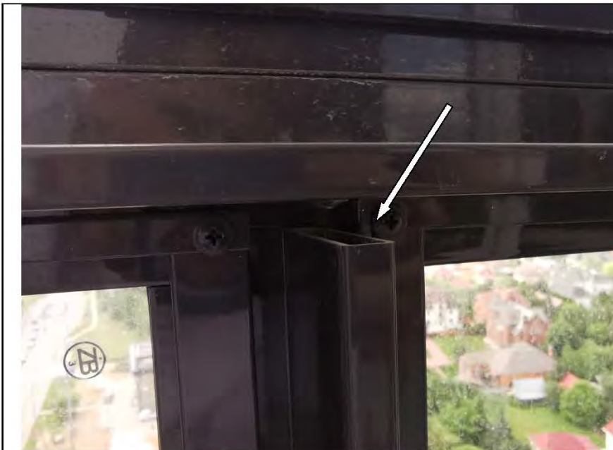
Фото №34. Зазор в месте стыка профилей металлического оконного блока на лоджии.
