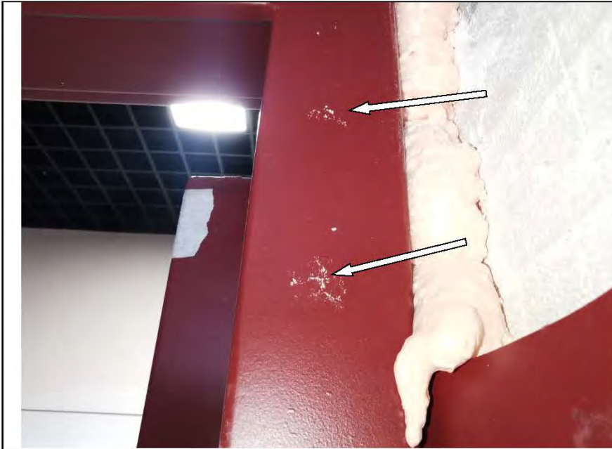
Фото №46. Загрязнения на коробе входного дверного блока.
