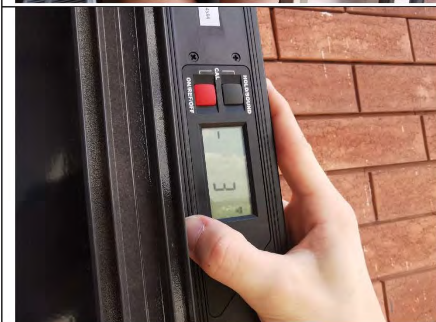
Фото №42. Отклонение металлического оконного блока по уровню вертикальности.
