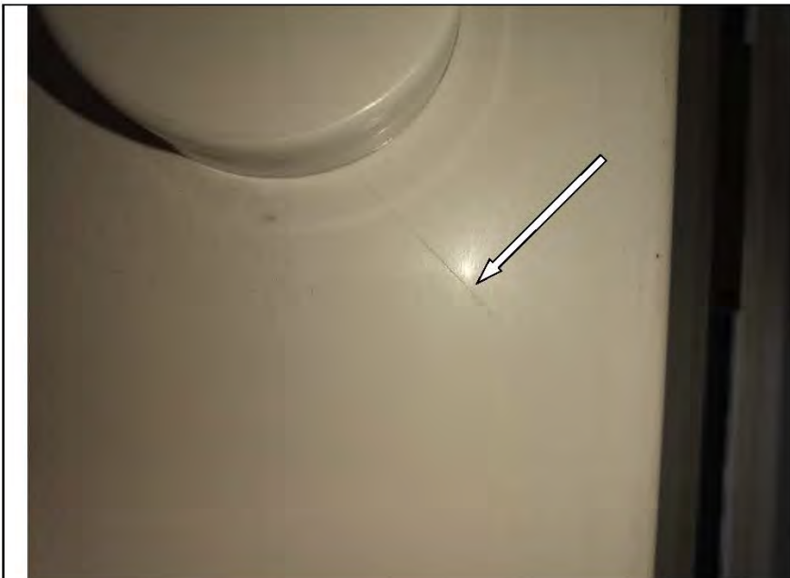
Фото №22. Царапины на профиле ПВХ балконного блока.
