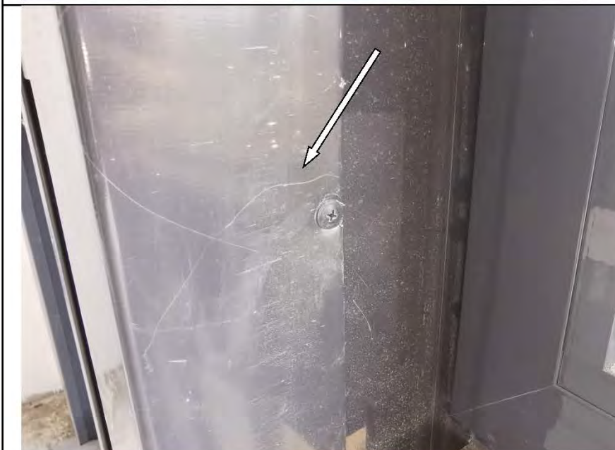
Фото №32. Царапины на профиле металлического оконного блока на лоджии.
