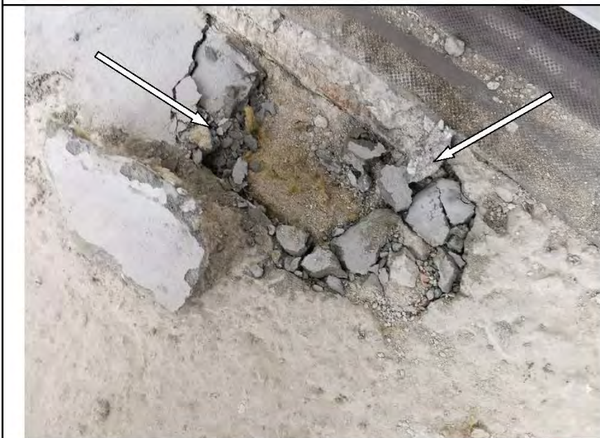
Фото №14. Отсутствие однородности внешнего вида железобетонных элементов конструкции пола в помещении (потеря несущей способности).
