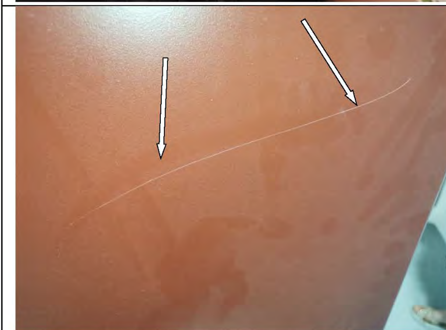
Фото №44. Царапины на полотне входного дверного блока.
