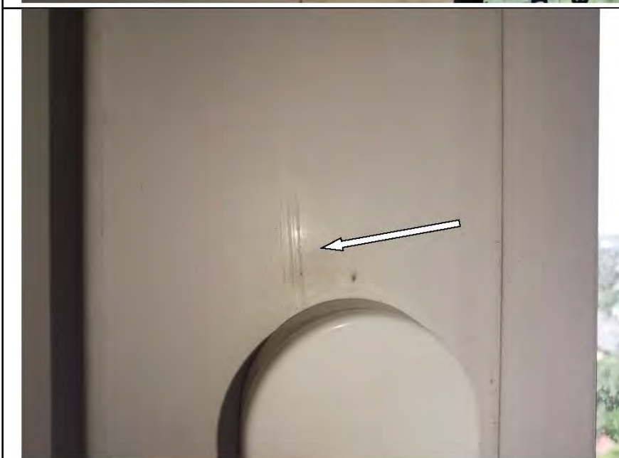
Фото №18. Царапины на профиле ПВХ оконного блока.
