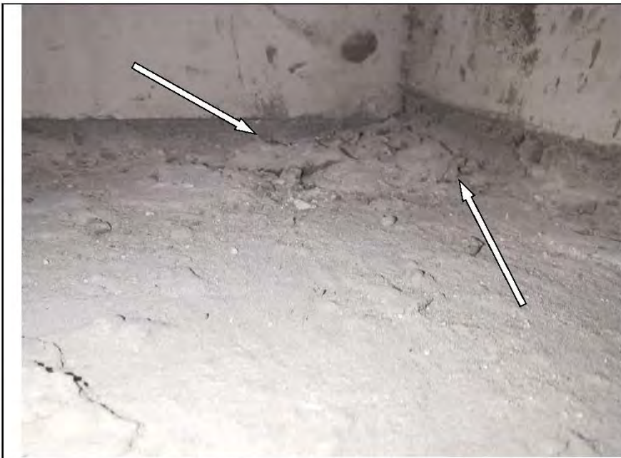
Фото №13. Отсутствие однородности внешнего вида железобетонных элементов конструкции пола в помещении.
