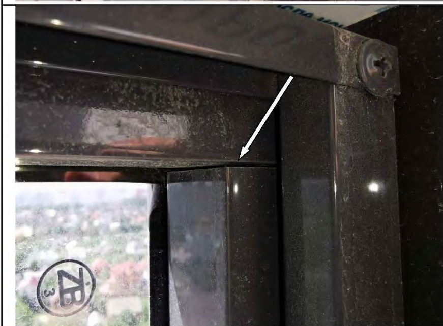
Фото №33. Зазор в месте стыка профилей металлического оконного блока на лоджии.
