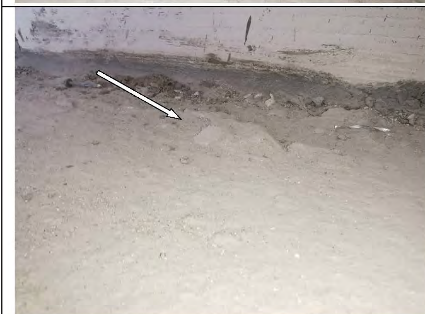
Фото №12. Отсутствие однородности внешнего вида железобетонных элементов конструкции пола в помещении.
