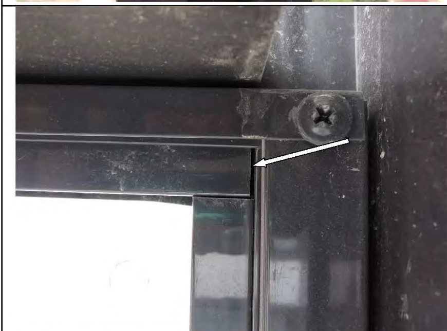
Фото №35. Зазор в месте стыка профилей металлического оконного блока на лоджии.
