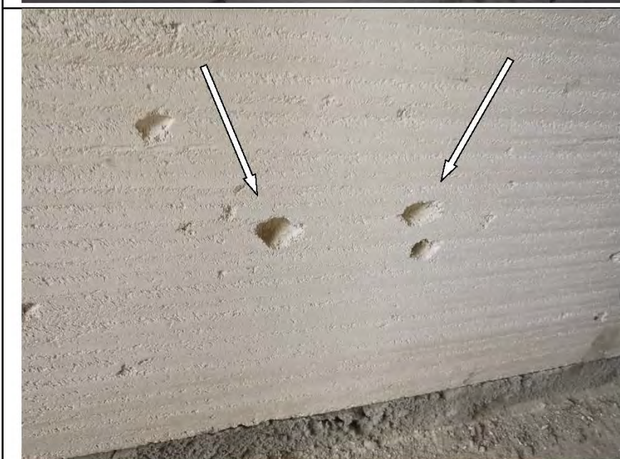
Фото №9. Неоднородность поверхности конструкции каменной кладки в помещении.
