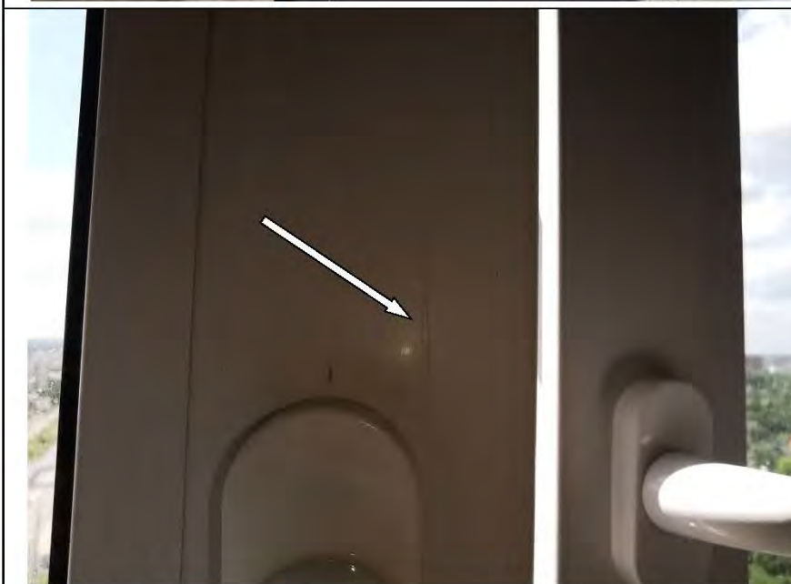
Фото №20. Царапины на профиле ПВХ оконного блока.
