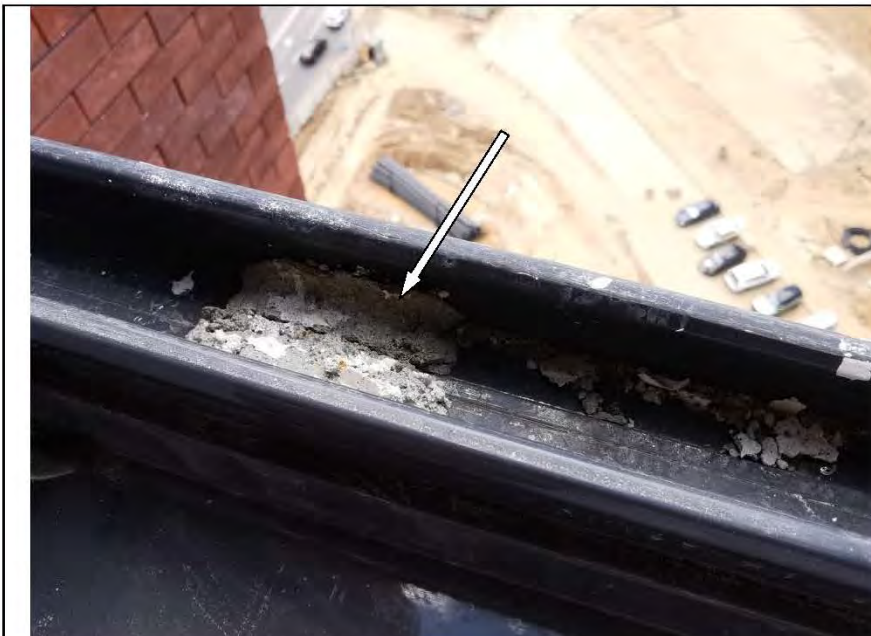
Фото №31. Загрязнения на профиле металлического оконного блока на лоджии.
