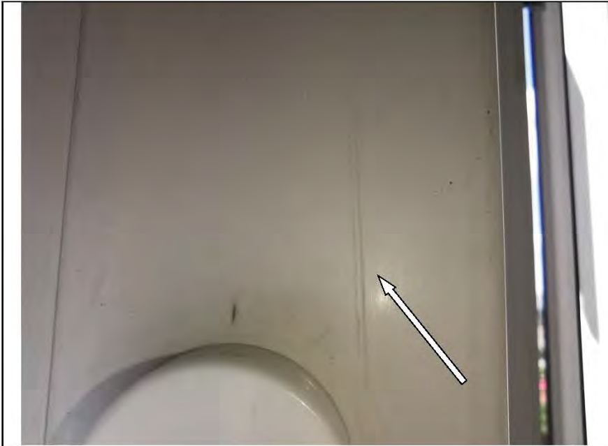
Фото №16. Царапины на профиле ПВХ оконного блока.
