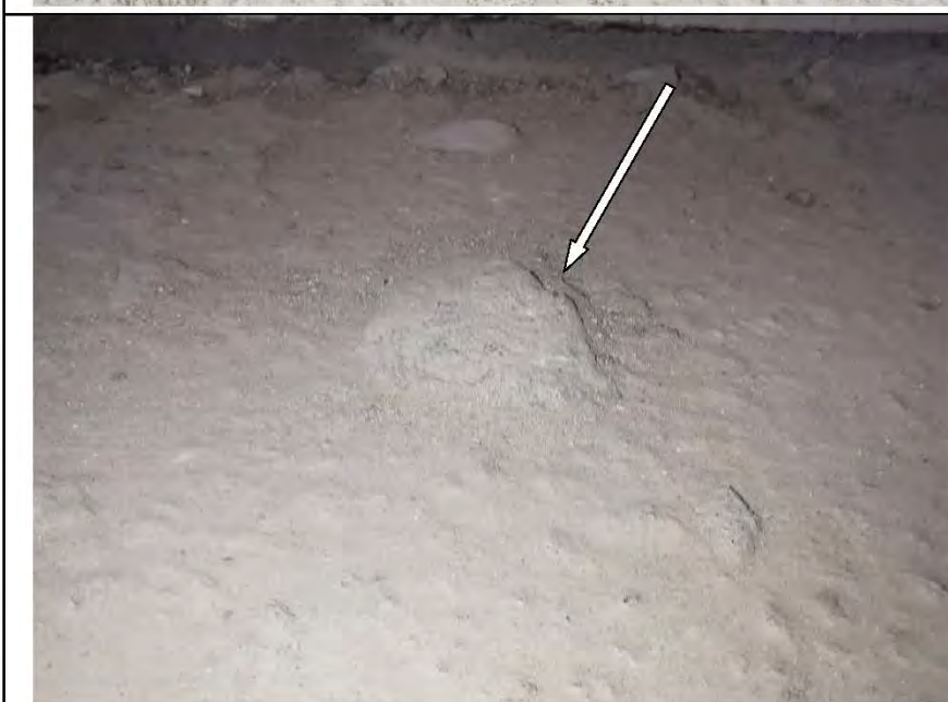
Фото №11. Отсутствие однородности внешнего вида железобетонных элементов конструкции пола в помещении.
