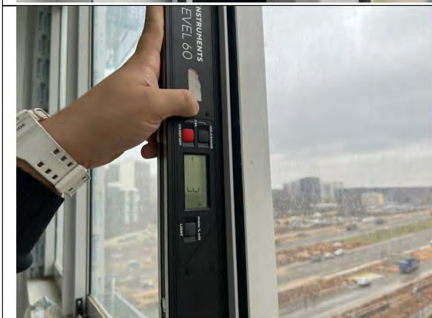
Фото №42. Отклонение металлического оконного блока на лоджии по уровню вертикальности составляет 3 мм.
