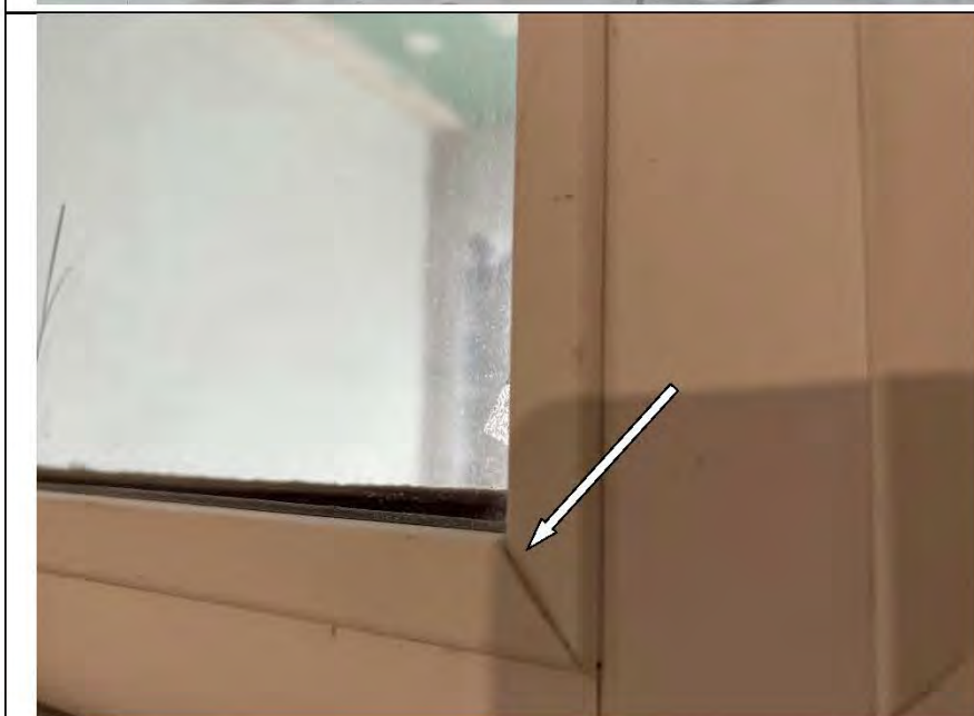
Фото №24. Зазоры в стыках профилей ПВХ оконного блока в кухне.
