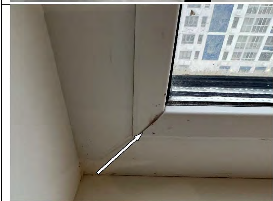
Фото №18. Зазоры в стыках профилей ПВХ оконного блока в спальне.
