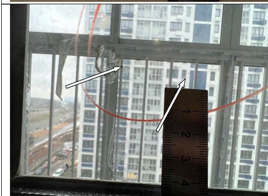
Фото №15. Окарины на стеклопакете оконного блока ПВХ в кухне.
