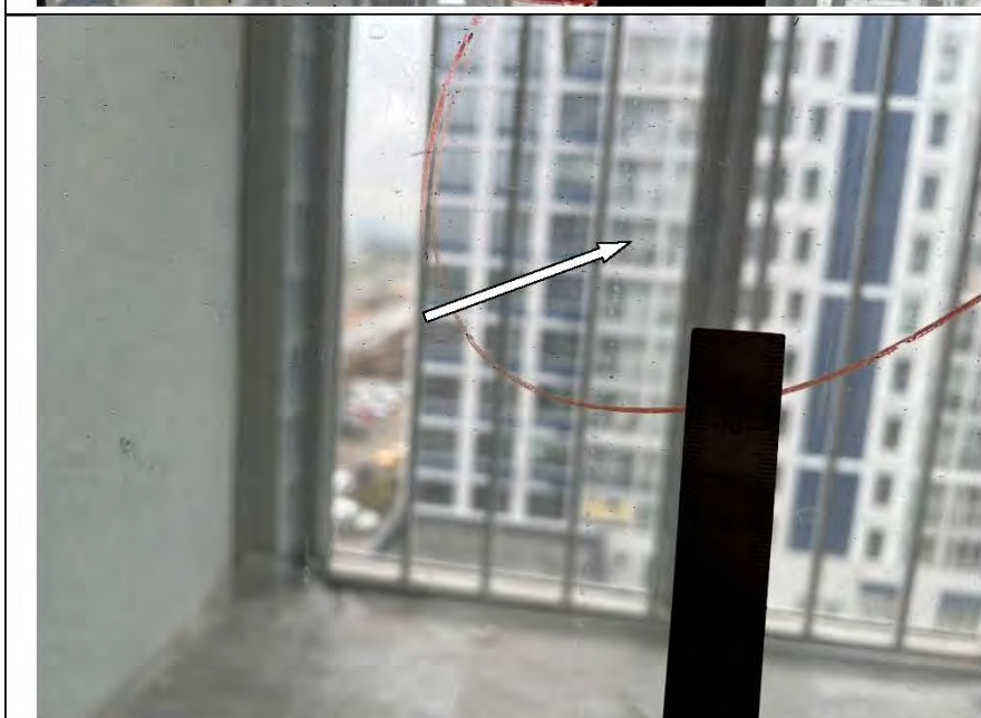
Фото №17. Окалины на стеклопакете оконного блока ПВХ в кухне.
