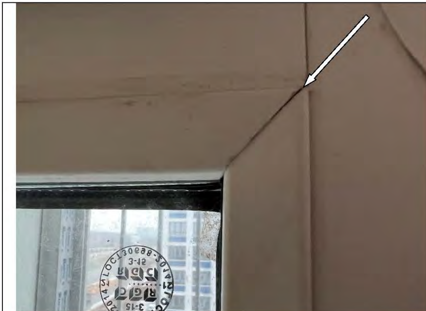
Фото №22. Зазоры в стыках профилей ПВХ оконного блока в кухне.
