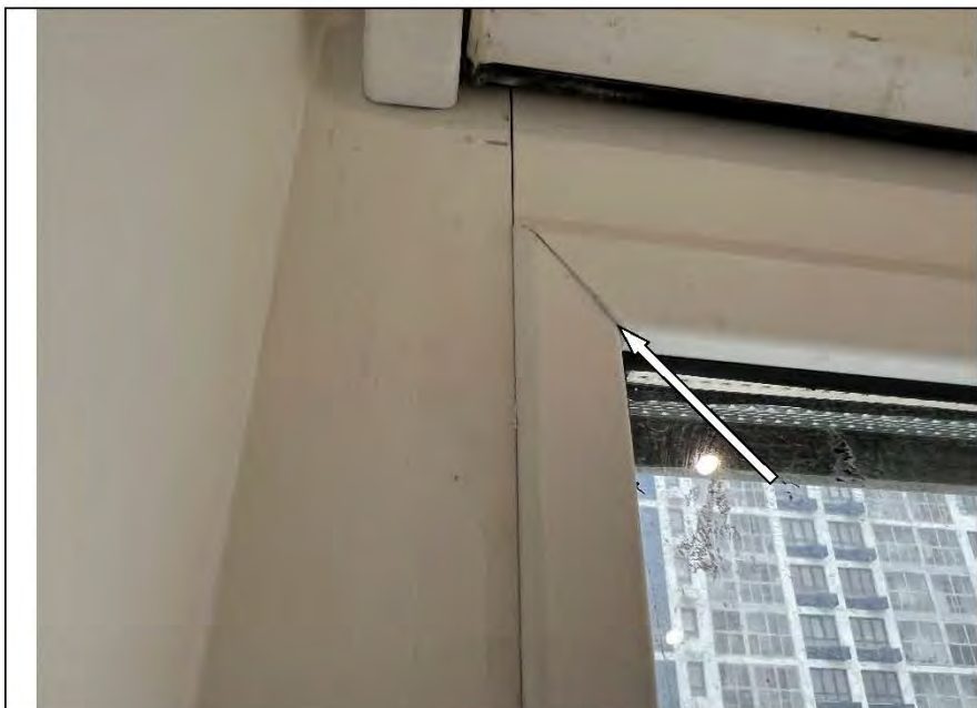
Фото №19. Зазоры в стыках профилей ПВХ оконного блока в спальне.
