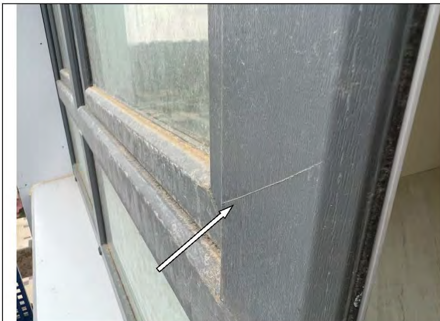
Фото №28. Царапина на профиле ПВХ оконного блока в спальне.
