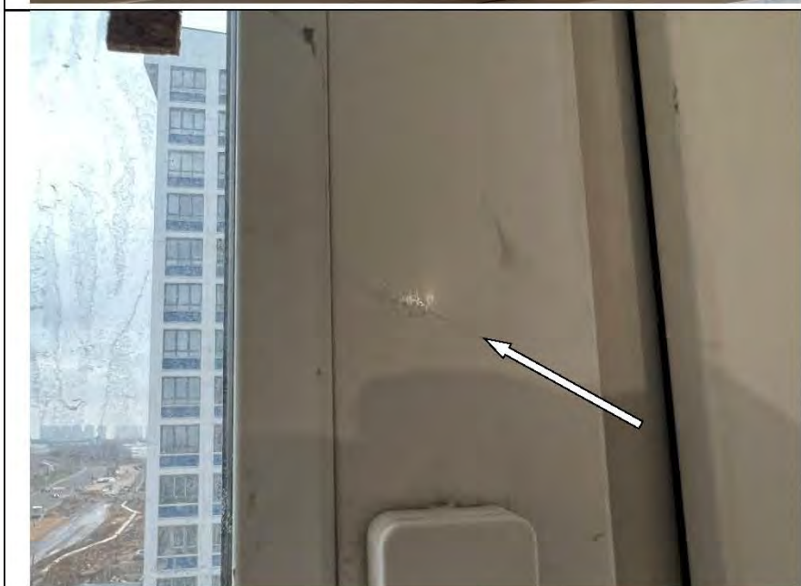
Фото №26. Царапина на профиле ПВХ оконного блока в спальне.
