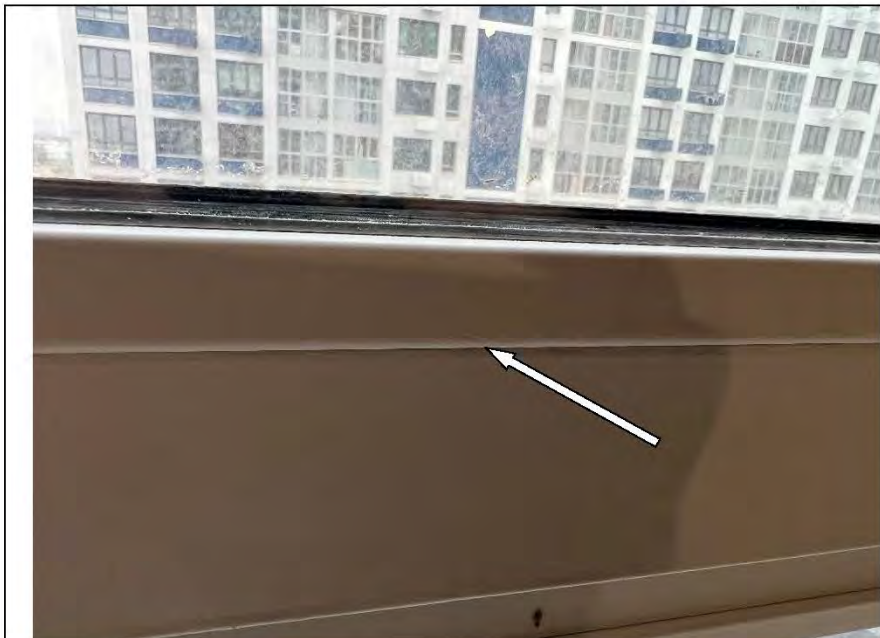
Фото №25. Царапина на профиле ПВХ оконного блока в спальне.
