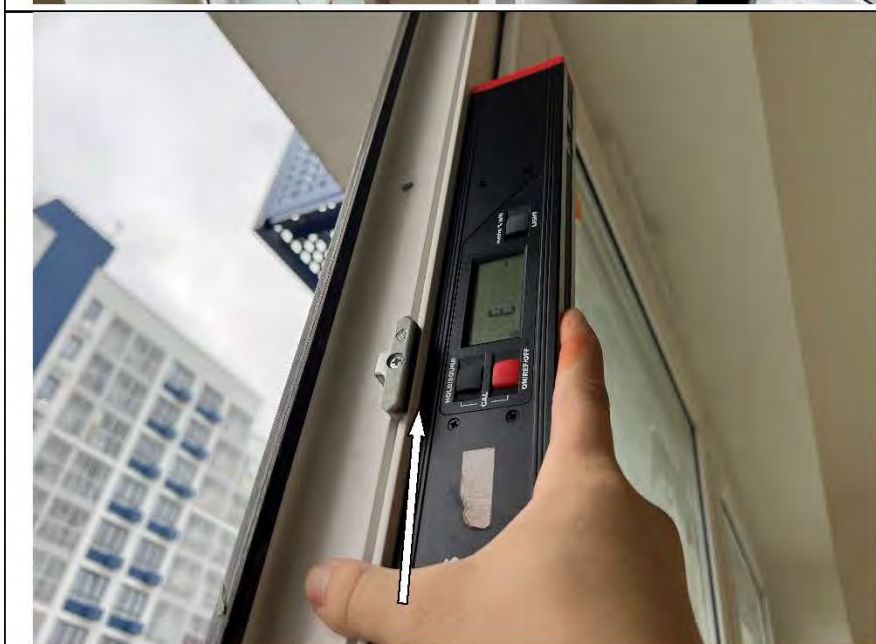
Фото №33. Отклонение оконного блока ПВХ в спальне по уровню вертикальности составляет 3 мм.
