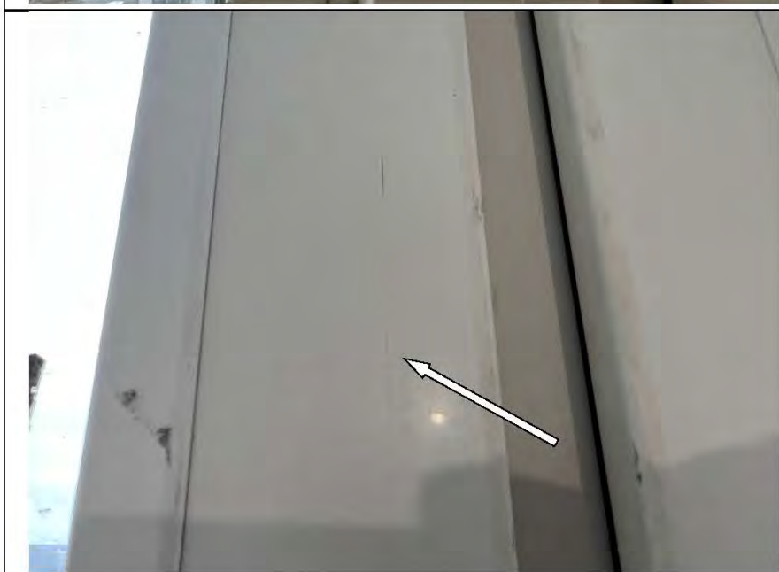
Фото №27. Царапина на профиле ПВХ оконного блока в спальне.
