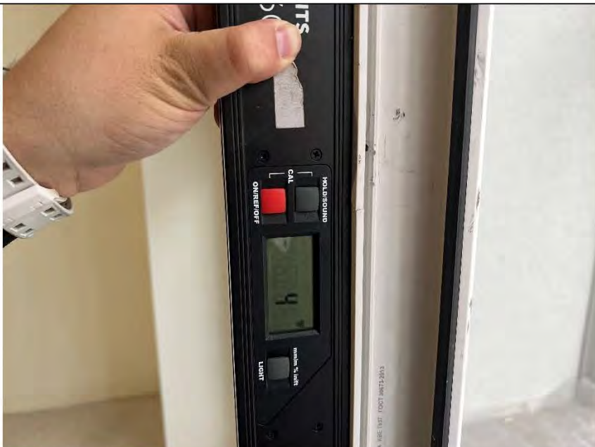
Фото №34. Отклонение дверного блока ПВХ в кухне по уровню вертикальности составляет 4 мм.
