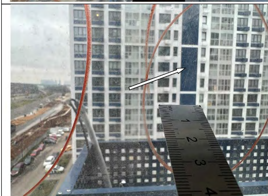
Фото №11. Царапина на стеклопакете оконного блока ПВХ в спальне.
