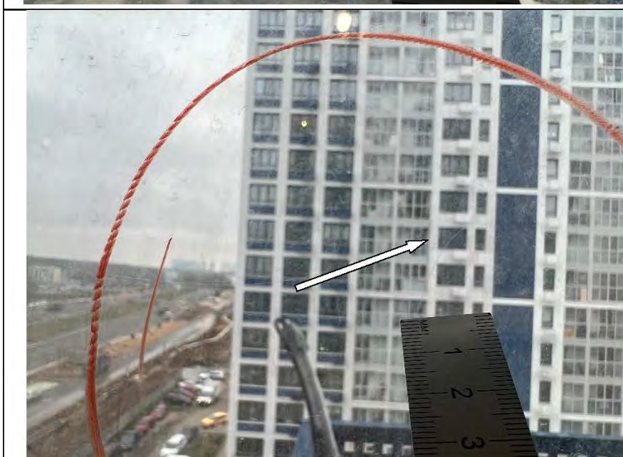
Фото №9. Царапина на стеклопакете оконного блока ПВХ в спальне.
