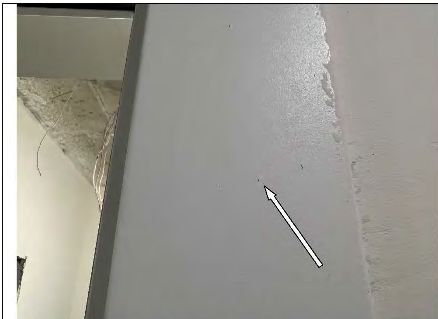
Фото №40. Сколы на коробе входного дверного блока.
