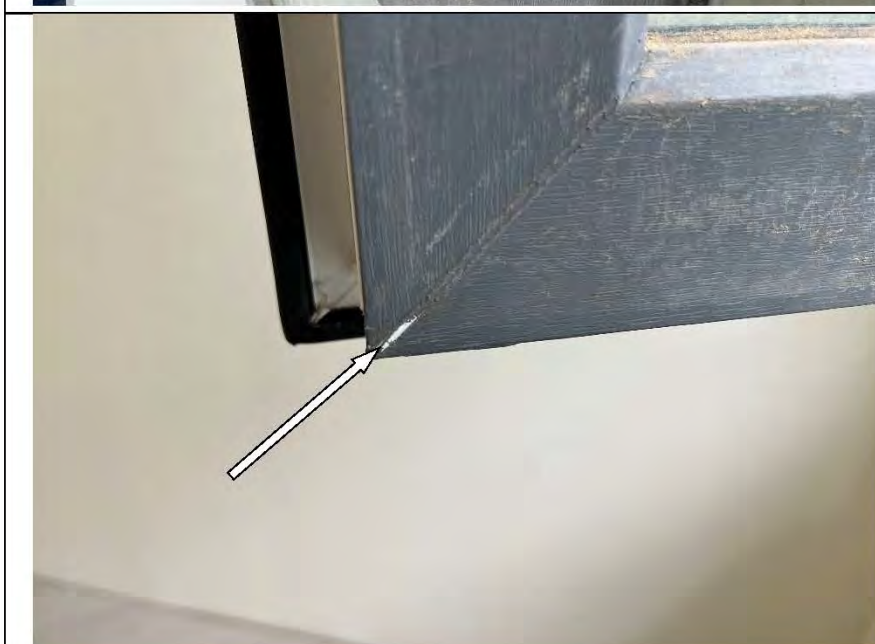
Фото №29. Царапина на профиле ПВХ оконного блока в спальне.
