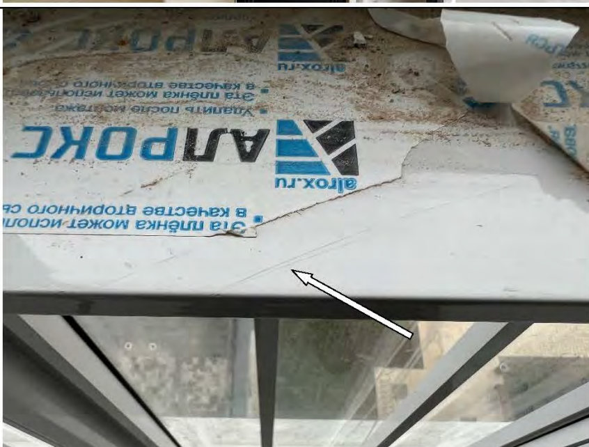
Фото №35. Царапины на металлическом профиле оконного блока на лоджии.
