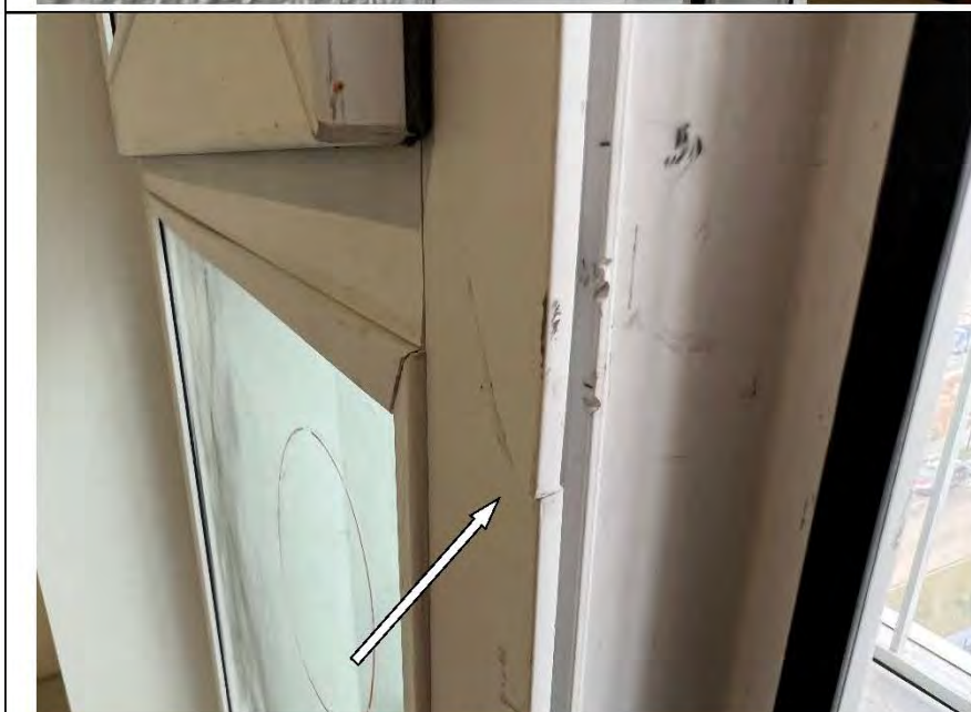
Фото №32. Лопнутый короб дверного блока ПВХ на лоджию.
