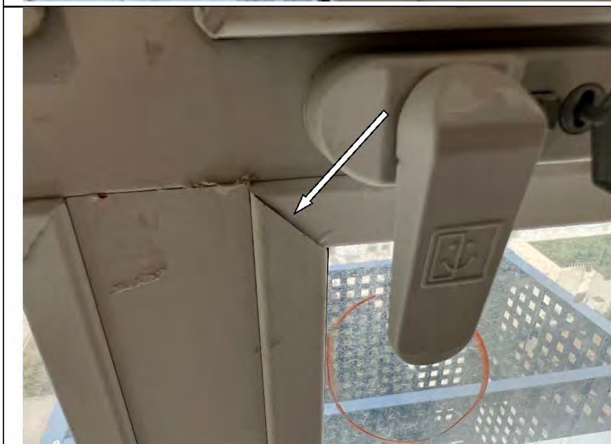
Фото №21. Зазоры в стыках профилей ПВХ оконного блока в спальне.
