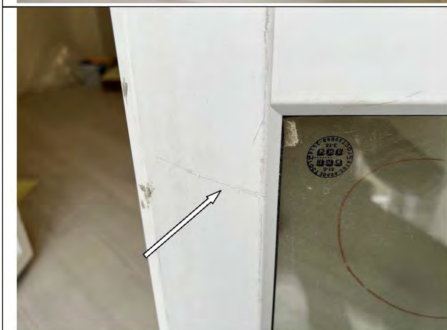
Фото №30. Царапина на профиле ПВХ оконного блока в кухне.
