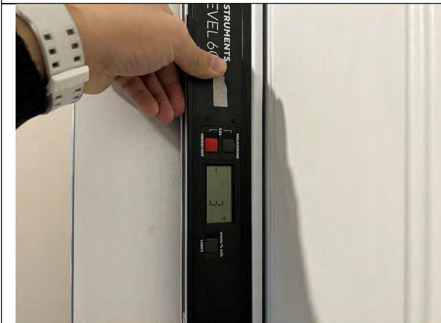
Фото №38. Отклонение коробки входного дверного блока составляет 3 мм.
