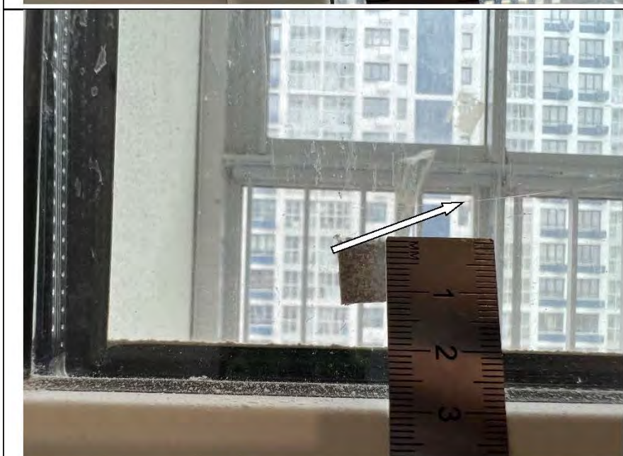
Фото №14. Царапина на стеклопакете оконного блока ПВХ в кухне.
