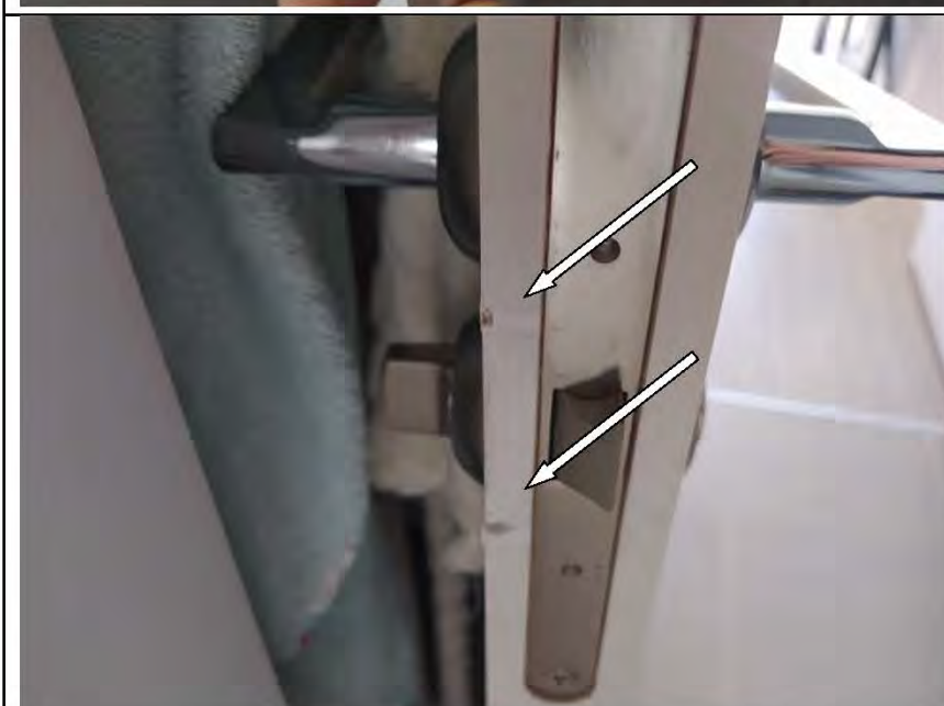
Фото №45. Дефекты (скол) на лицевой поверхности полотна деревянного дверного блока в ванной комнате
