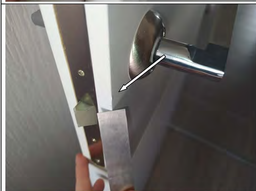
Фото №44. Дефекты (скол) на лицевой поверхности полотна деревянного дверного блока в кухне
