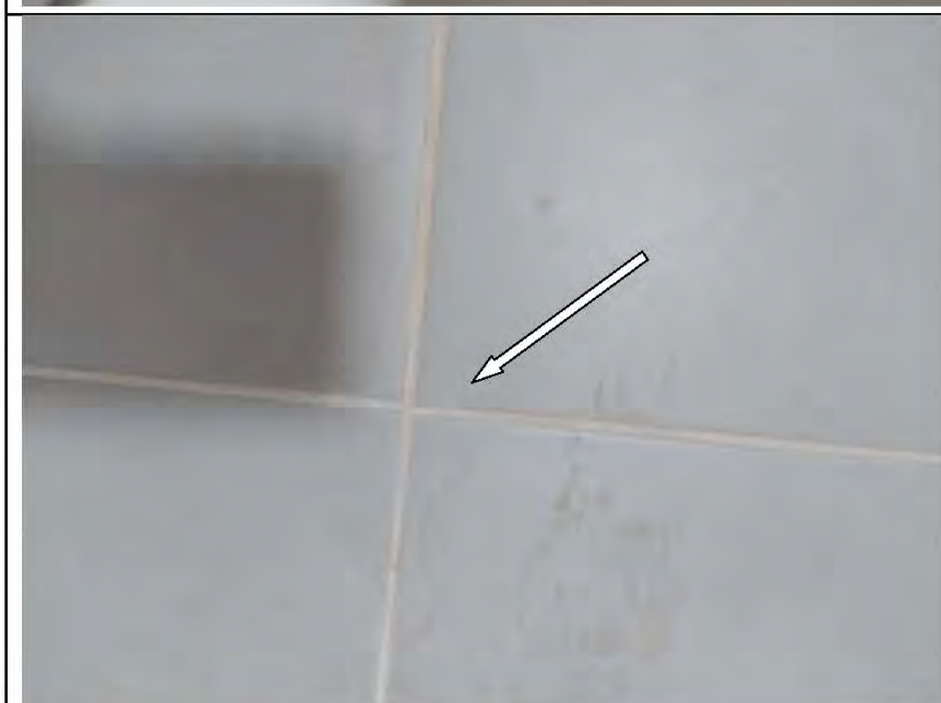
Фото №56. Затирка напольной плитки выполнена с нарушениями в санузле: разность ширины шва.
