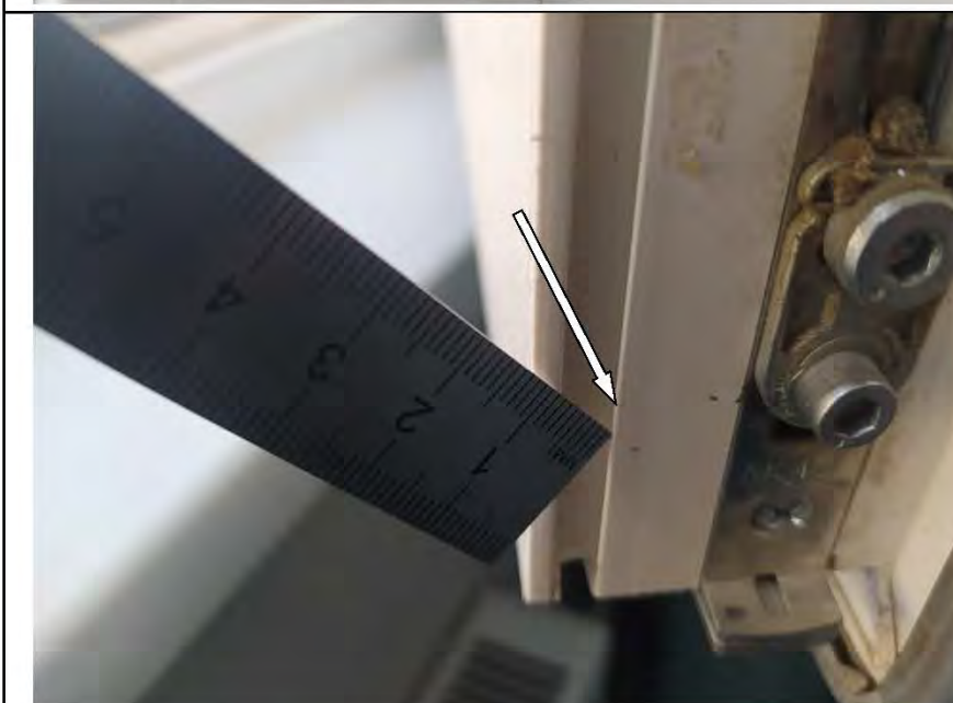
Фото №29. Профиль ПВХ оконного блока в спальне имеет дефекты (скол).
