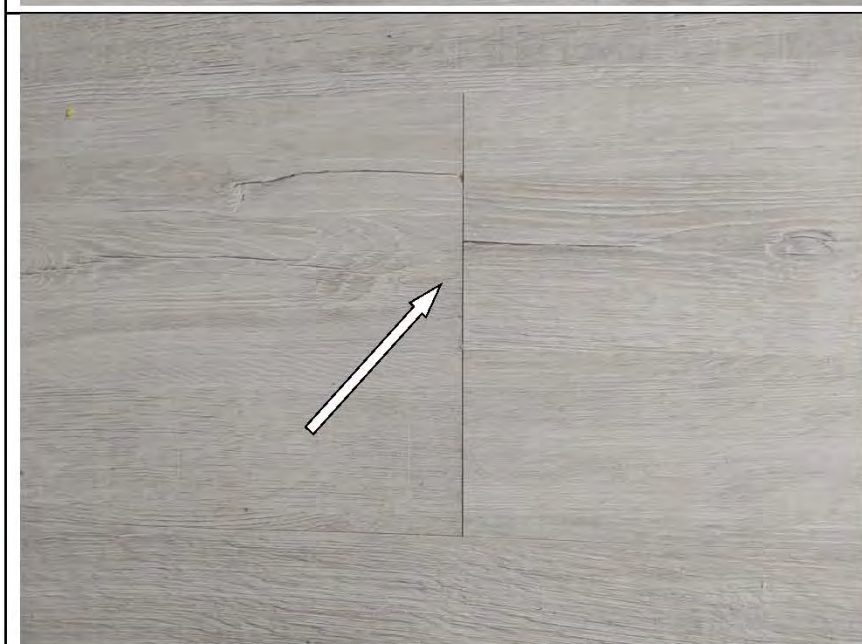
Фото №62. Зазор между соседними досками ламината на кухне
