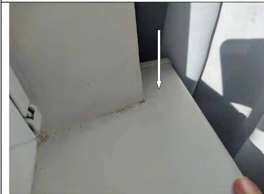
Фото №32. На лицевой поверхности подоконной доски в гостиной имеются дефекты (царапины).
