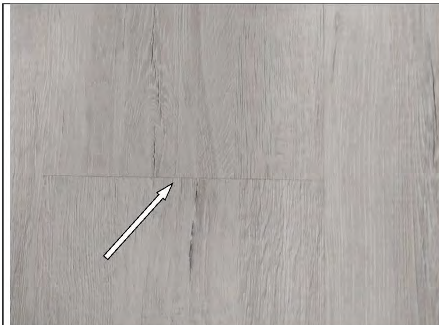
Фото №64. Зазор между соседними досками ламината в гостиной
