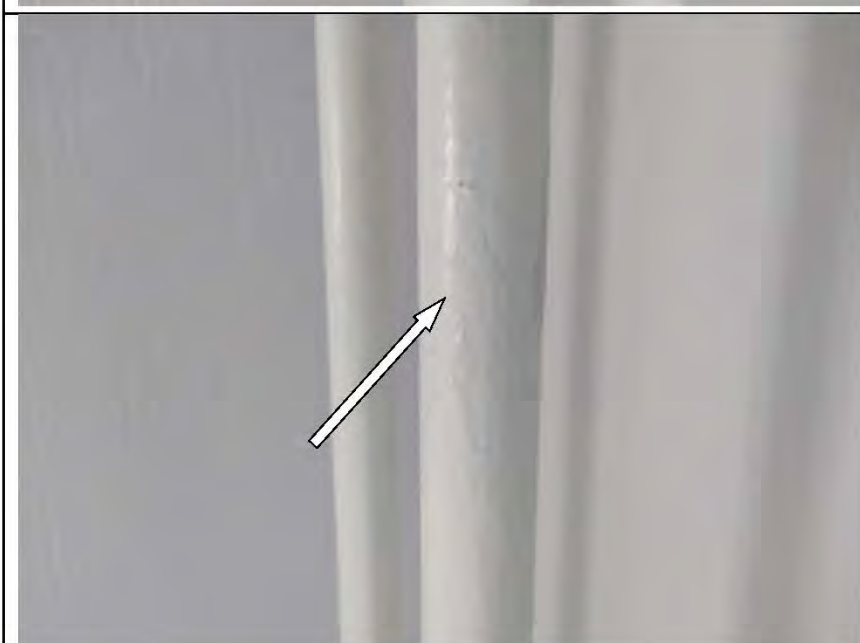
Фото №69. Окрашивание труб отопления выполнено с дефектами (подтеки) в спальне
