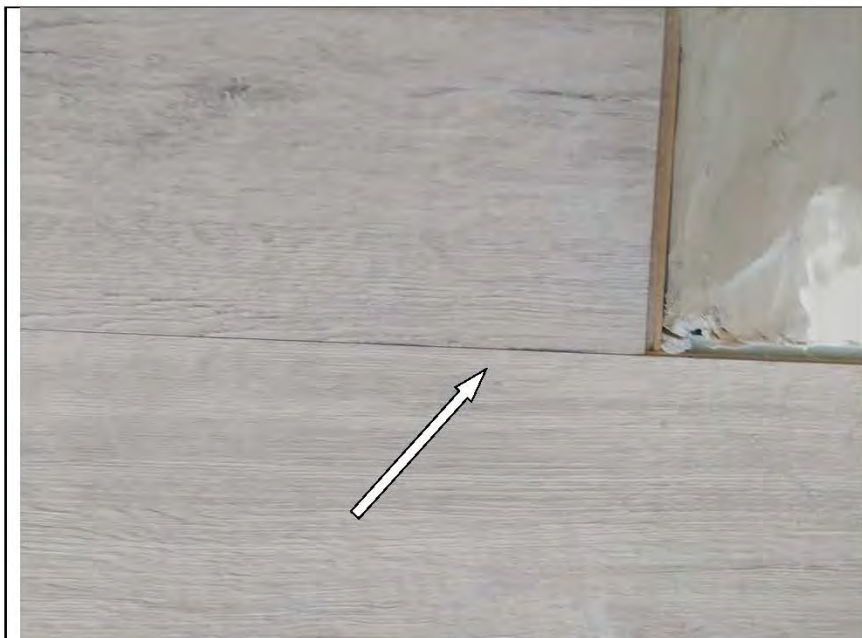
Фото №61. Зазор между соседними досками ламината на лоджии
