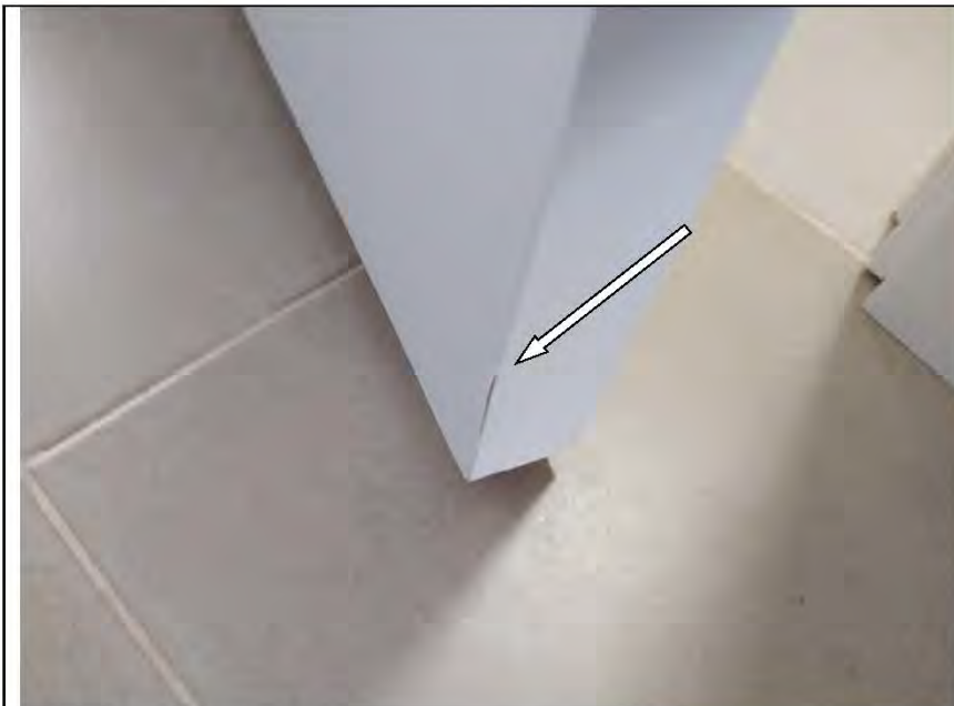
Фото №46. Дефекты (отслоение ламинации) на лицевой поверхности полотна деревянного дверного блока в санузле
