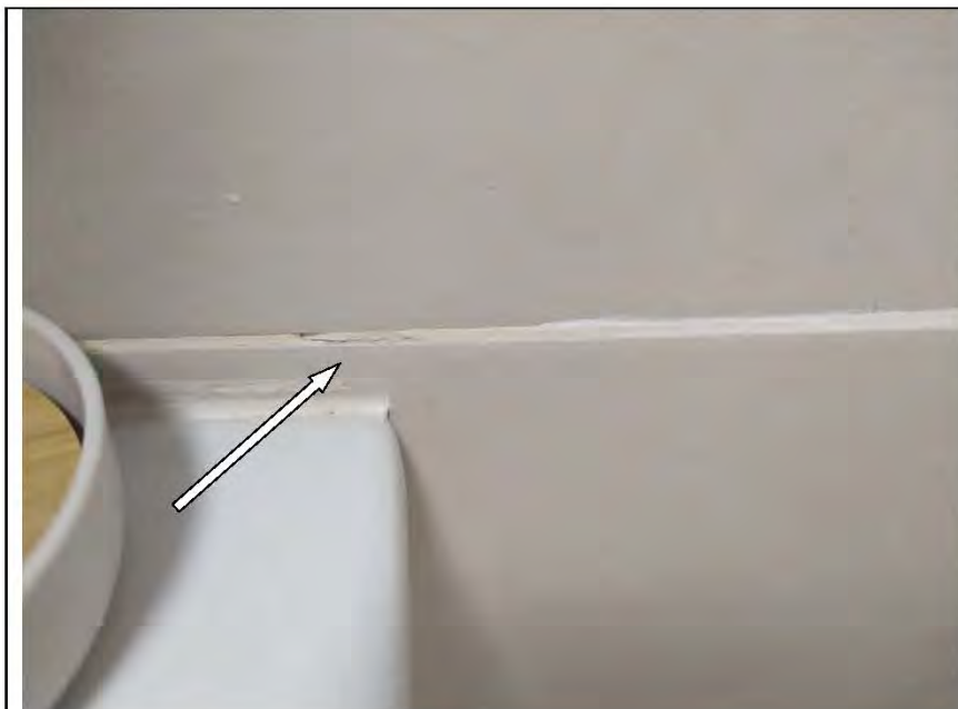
Фото №55. Затирка настенной плитки в ванной комнате выполнена с нарушениями (каверны).
