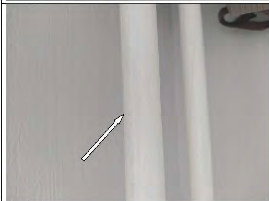
Фото №68. Окрашивание труб отопления выполнено с дефектами (подтеки) на лоджии
