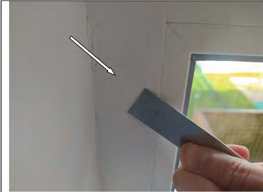
Фото №25. Профиль ПВХ оконного блока на лоджии имеет дефекты (царапина).
