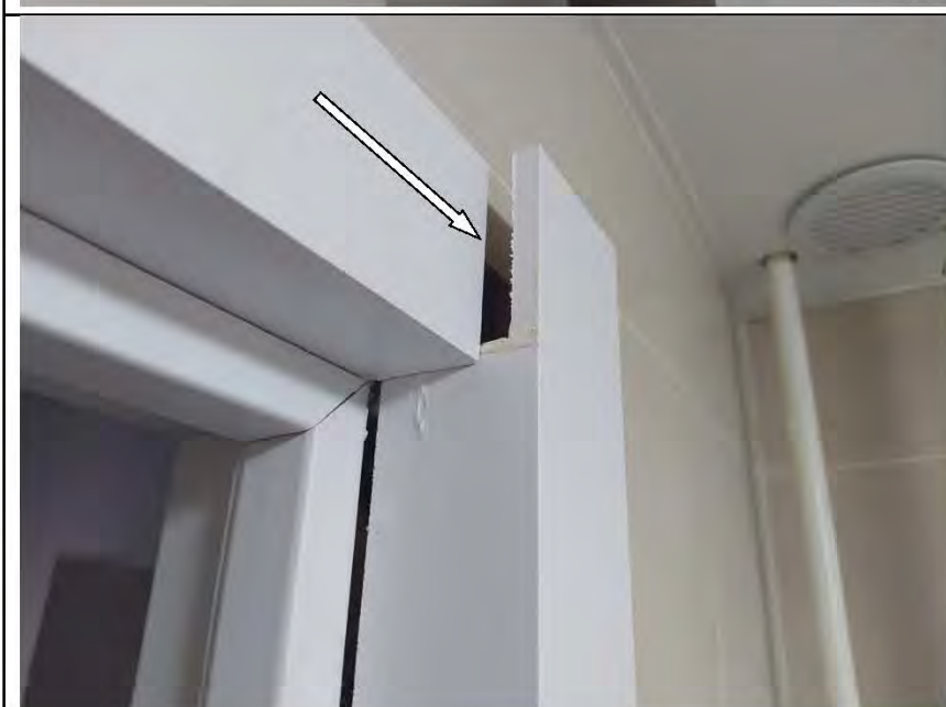
Фото №48. Неплотное прилегание дверного наличника к стене в ванной комнате.
