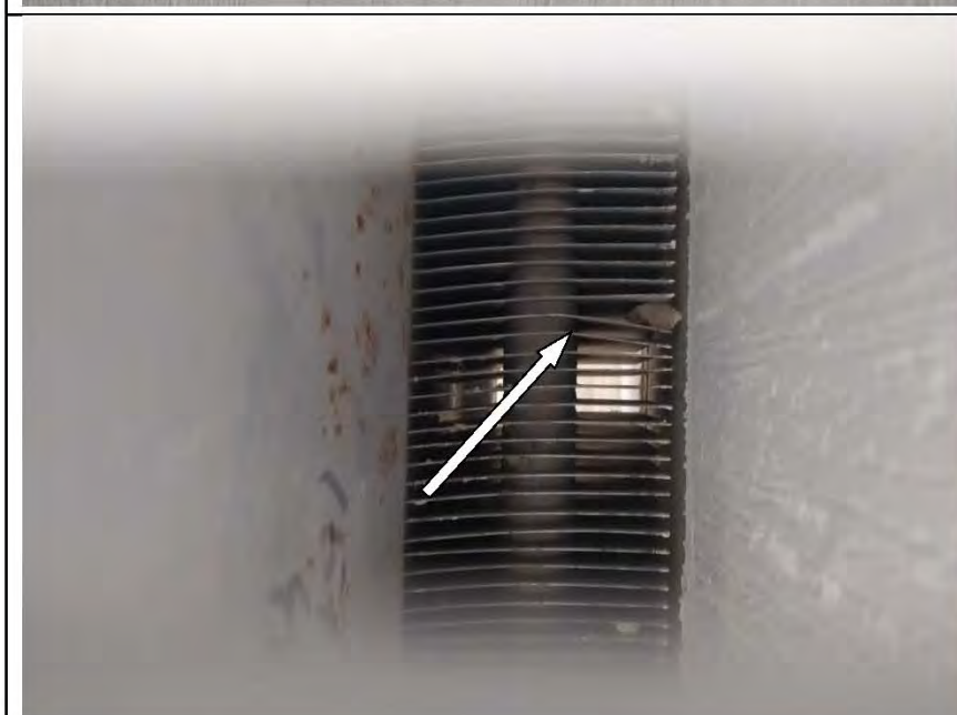
Фото №65. Радиатор на лоджии имеет дефекты (загрязнения, замятия).
