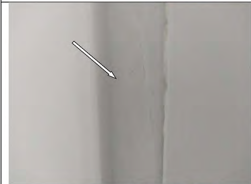
Фото №26. Профиль ПВХ оконного блока в гостиной имеет дефекты (загрязнение малярными составами).
