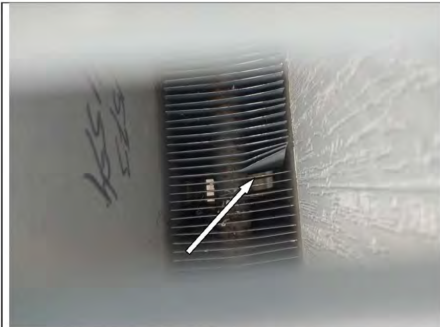
Фото №67. Радиатор в гостиной имеет дефекты (замятия).
