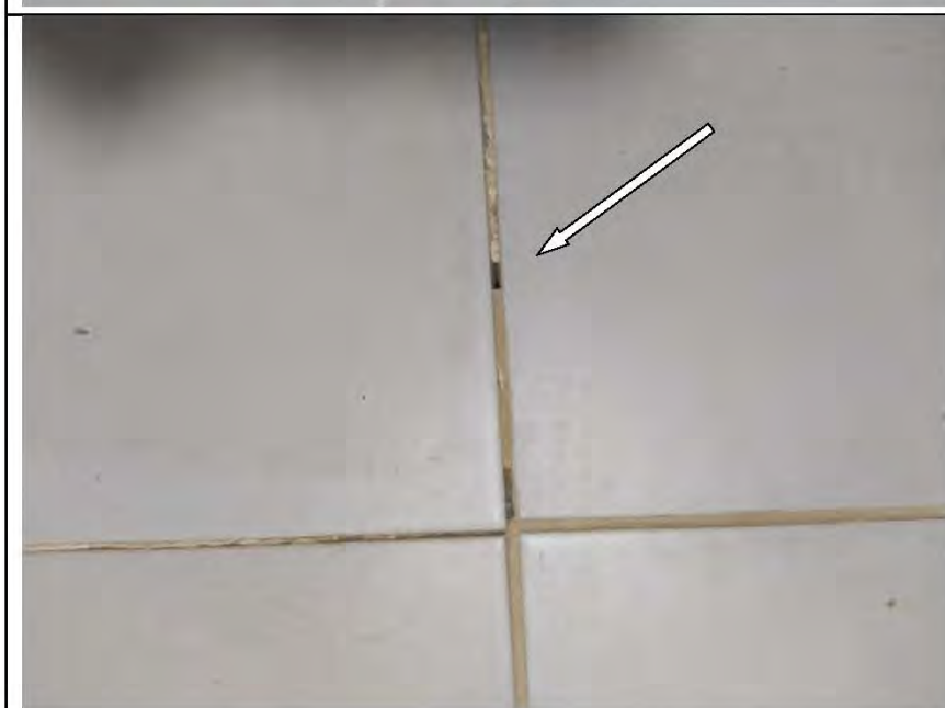
Фото №57. Затирка напольной плитки выполнена с нарушениями в ванной комнате: каверны.
