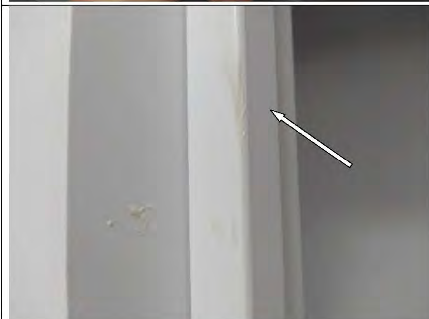
Фото №35. Коробка деревянного дверного блока в санузле имеет дефекты (загрязнение строительными составами).
