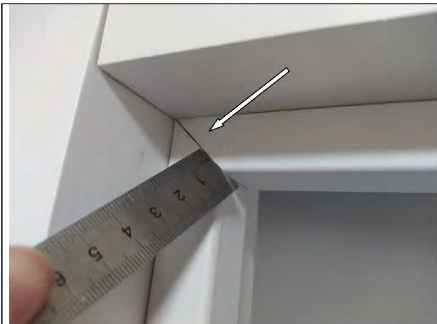
Фото №43. Элементы дверного блока соединены не надежно в санузле.
