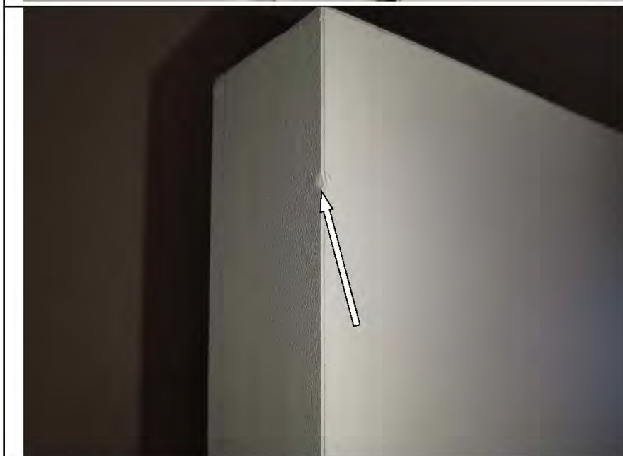
Фото №51. Повреждение ламинации полотна деревянного дверного блока в кухне.
