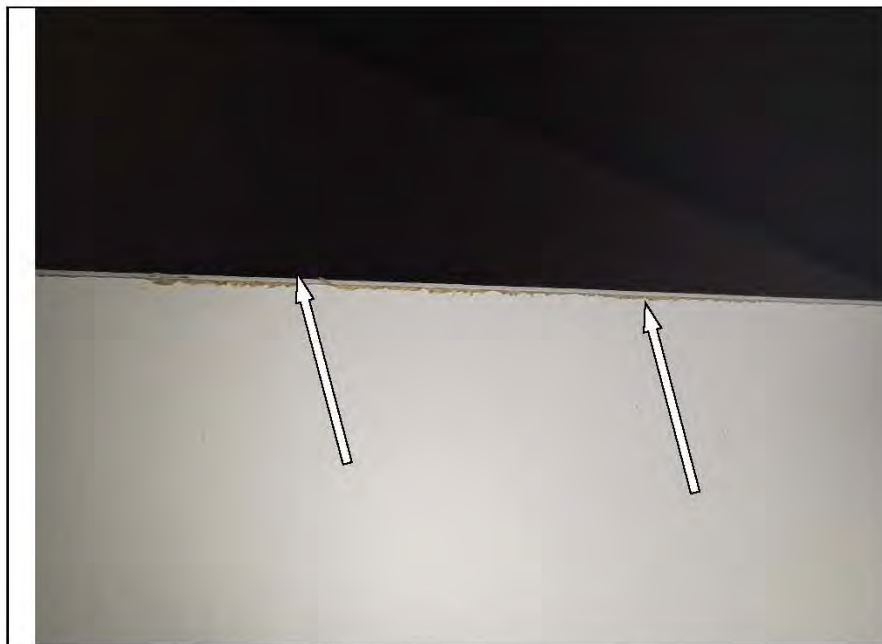
Фото №55. Повреждение ламинации полотна деревянного дверного блока в спальне.
