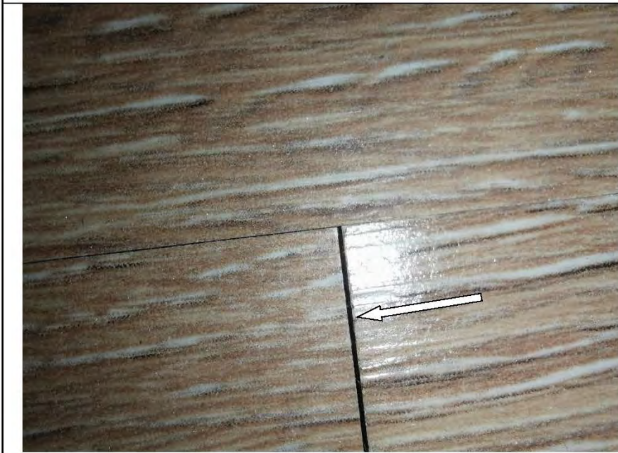
Фото №26. Зазор между соседними досками ламината в коридоре.
