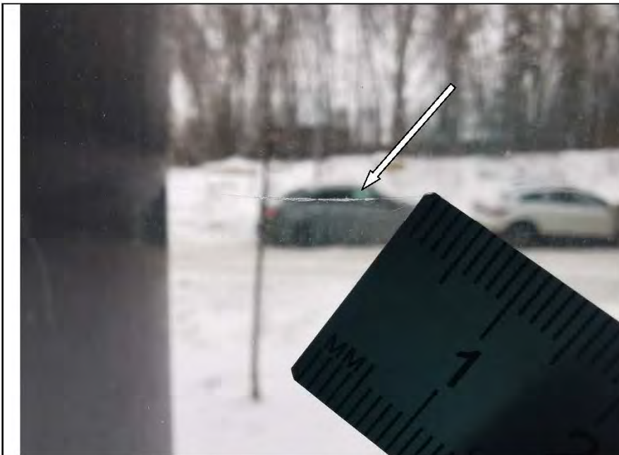
Фото №61. Царапины на стеклопакете оконного блока ПВХ в на кухне.
