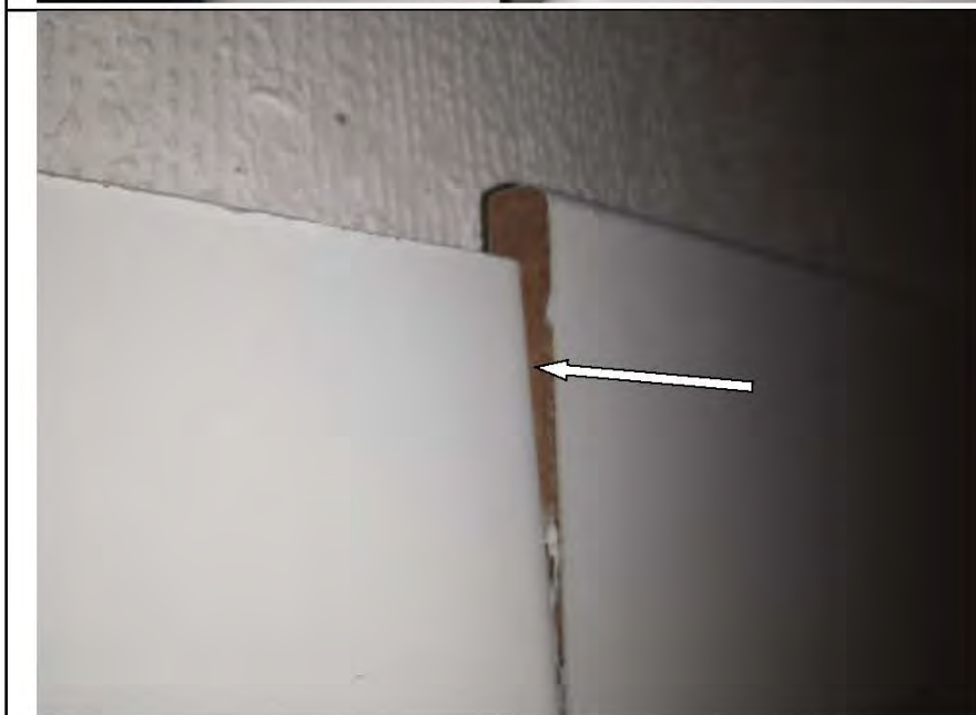
Фото №60. Элементы дверного блока (наличники) соединены не надежно в спальне.
