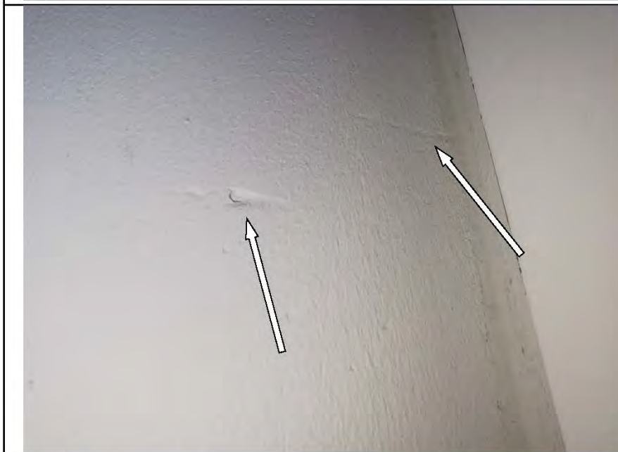
Фото №47. Поверхность откосов оконного блока в кухне не отшлифована перед окрашиванием.
