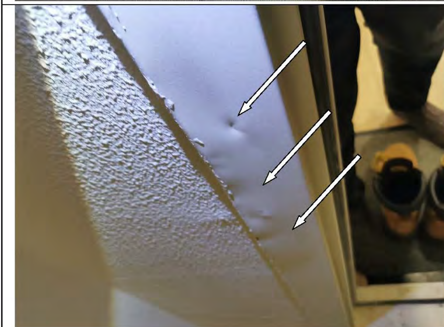
Фото №68. Вмятины на коробе входного дверного блока.
