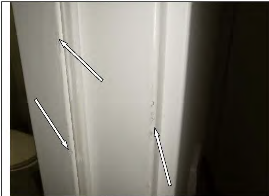
Фото №49. Потертости на коробе деревянного дверного блока в ванной комнате.
