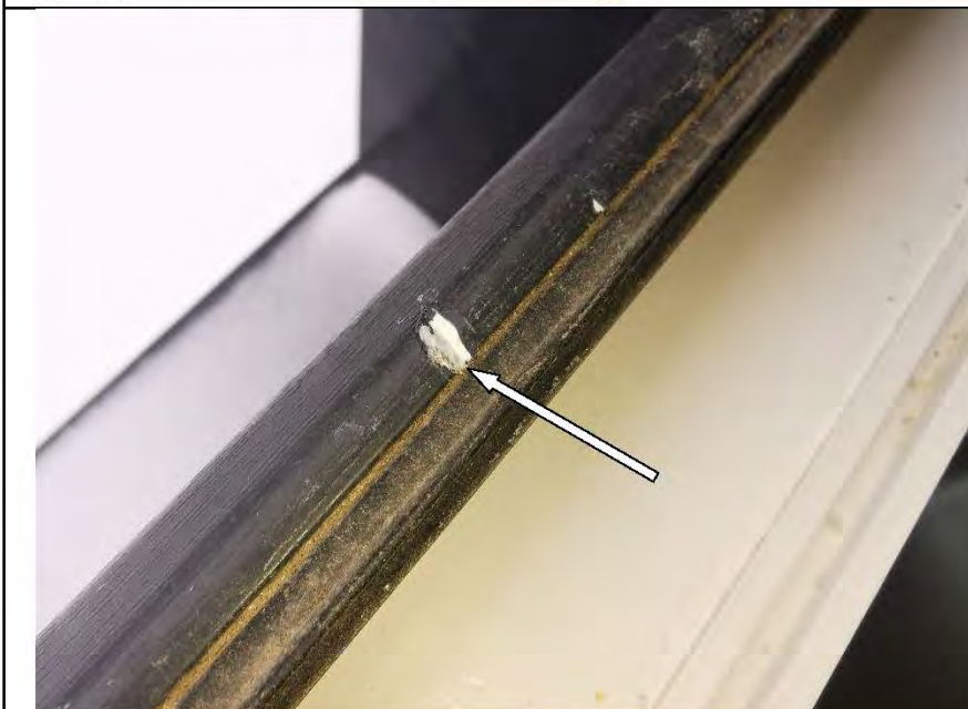
Фото №41. Потертости на профиле ПВХ оконного блока в кухне.
