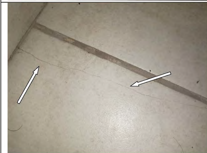
Фото №33. Цеки на напольной керамической плитке в ванной комнате.
