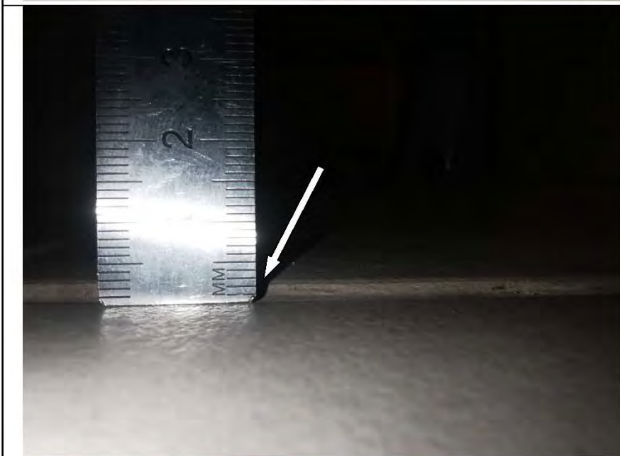
Фото №32. Уступы напольной керамической плитки в ванной комнате.
