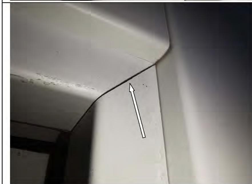
Фото №57. Элементы дверного блока (короба) соединены не надежно в кухне.
