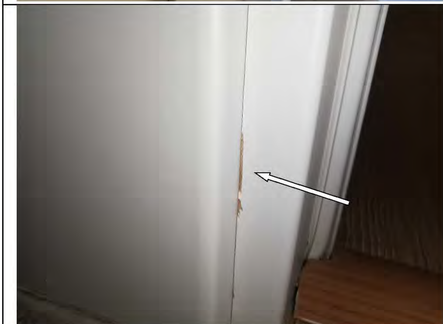
Фото №54. Повреждение ламинации короба деревянного дверного блока в спальне.
