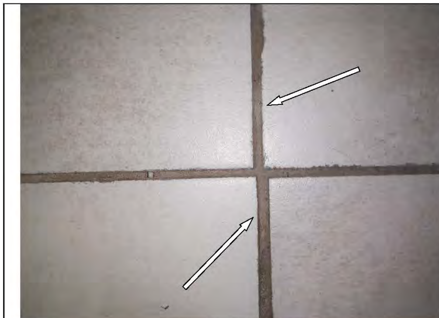
Фото №34. Некачественно выполнена затирка швов напольной керамической плитки в ванной комнате (отклонение ширины шва).
