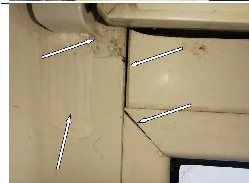
Фото №42. Зазор в месте стыка профилей ПВХ, загрязнение профиля ПВХ оконного блока в кухне.
