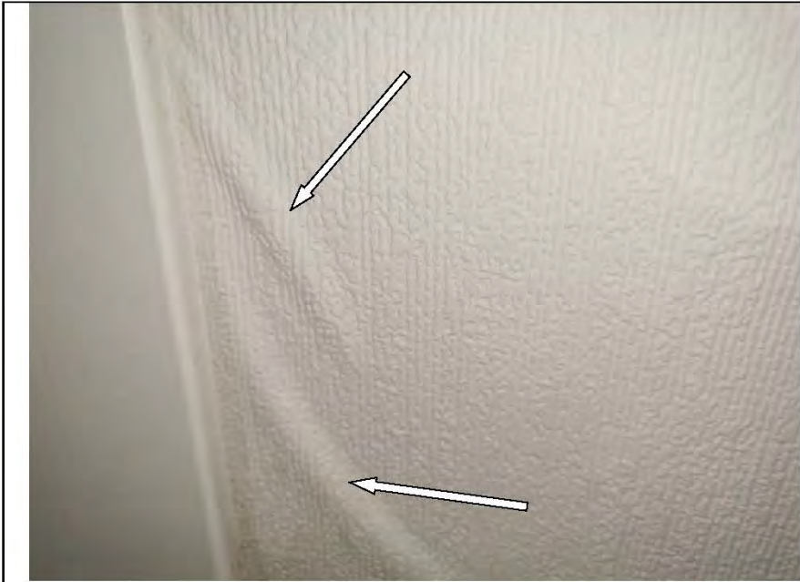
Фото №13. Вздутие обойного полотна в кухне.
