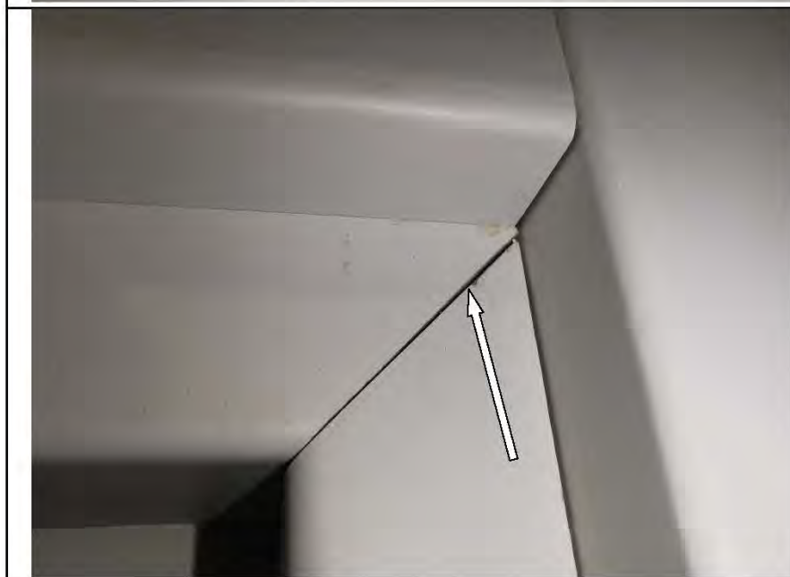
Фото №56. Элементы дверного блока (короба) соединены не надежно в ванной комнате.
