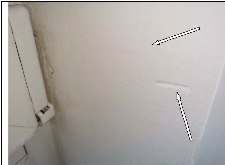
Фото №46. Поверхность откосов оконного блока в спальне не отшлифована перед окрашиванием.
