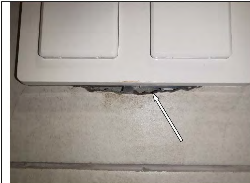
Фото №19. Отбитости на настенной керамической плитке в ванной комнате.
