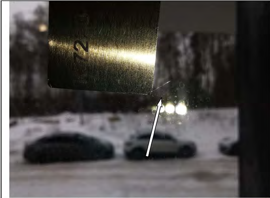
Фото №64. Царапины на стеклопакете оконного блока ПВХ в спальне.
