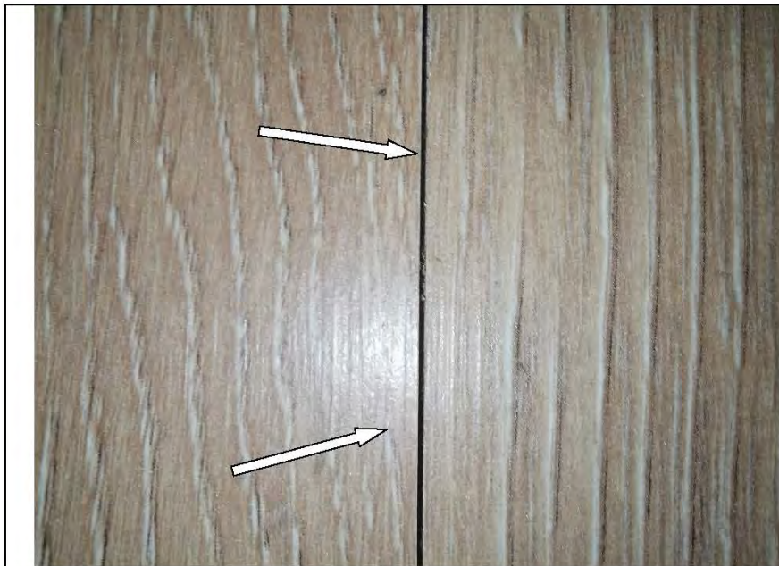
Фото №28. Зазор между соседними досками ламината в кухне.
