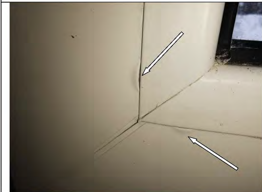
Фото №44. Деформация профиля ПВХ оконного блока в спальне.
