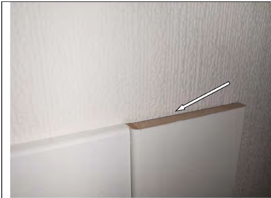
Фото №58. Элементы дверного блока (наличники) соединены не надежно в кухне.
