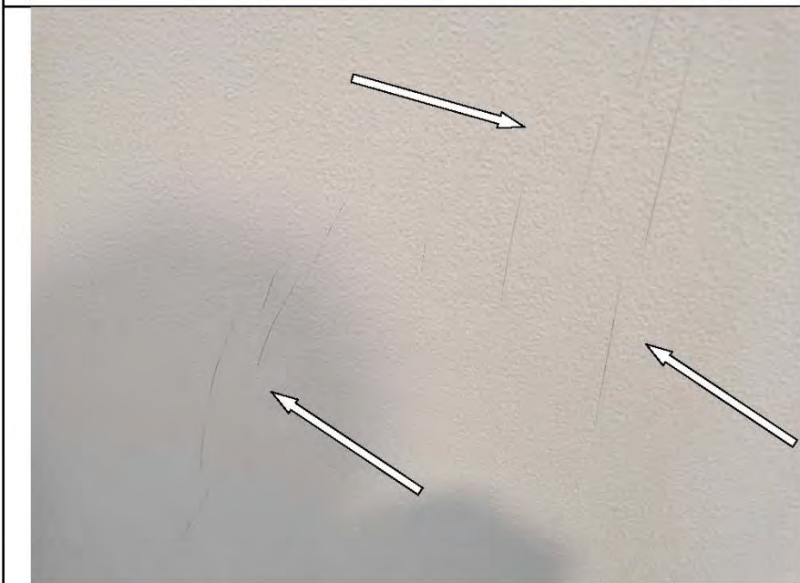
Фото №14. Повреждение целостности обойного полотна в кухне.
