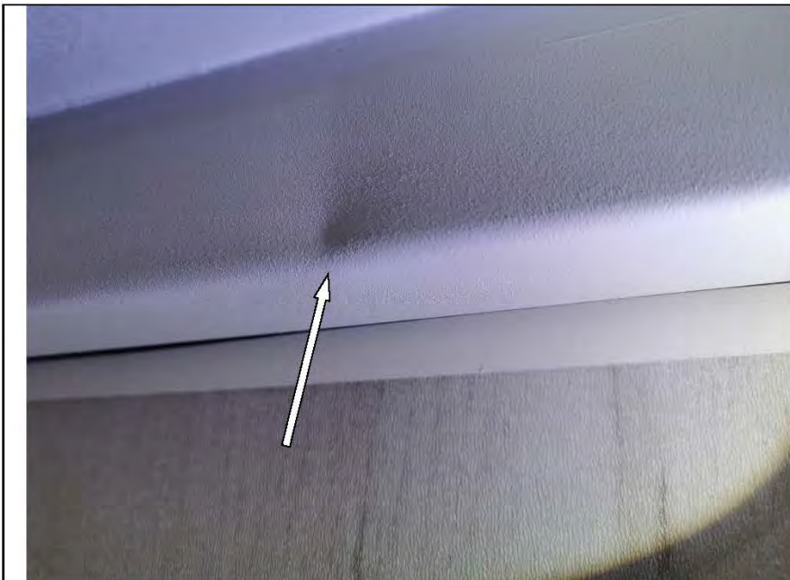
Фото №67. Вмятины на коробе входного дверного блока.
