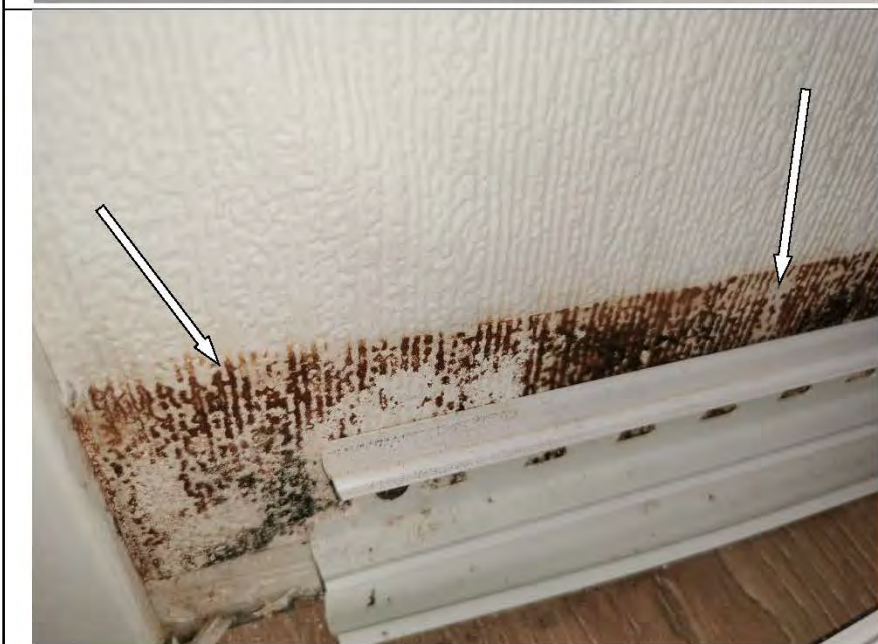
Фото №15. Поражение обойного полотна грибком в кухне.
