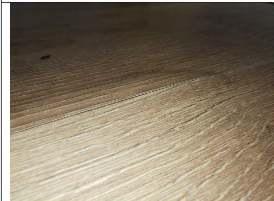
Фото №27. Вздутие ламината в кухне.
