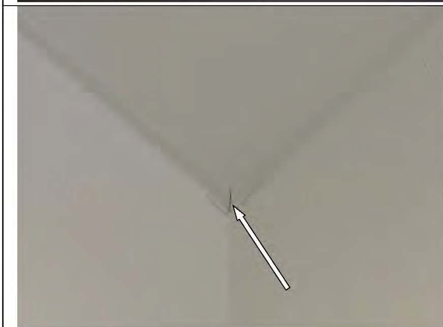
Фото №39. Дефект монтажа декоративного молдинга крепления натяжного потолка в кухне.
