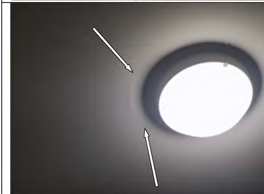
Фото №38. Видимость инженерных сетей на полотне натяжного потолка в ванной комнате.
