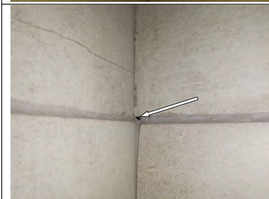
Фото №21. Неравномерное заполнение шовного пространства настенной керамической плитки затирочным составом в ванной комнате.
