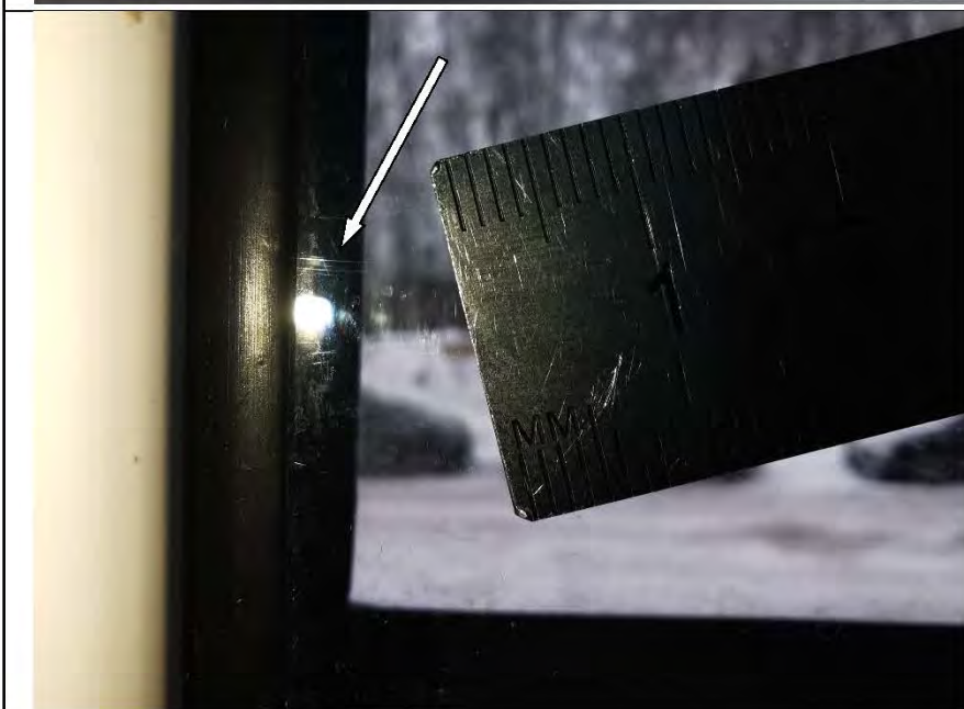
Фото №63. Царапины на стеклопакете оконного блока ПВХ в на спальне.
