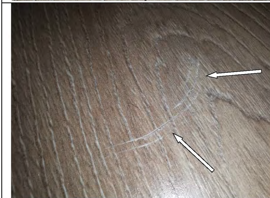
Фото №29. Царапины на ламинате в спальне.
