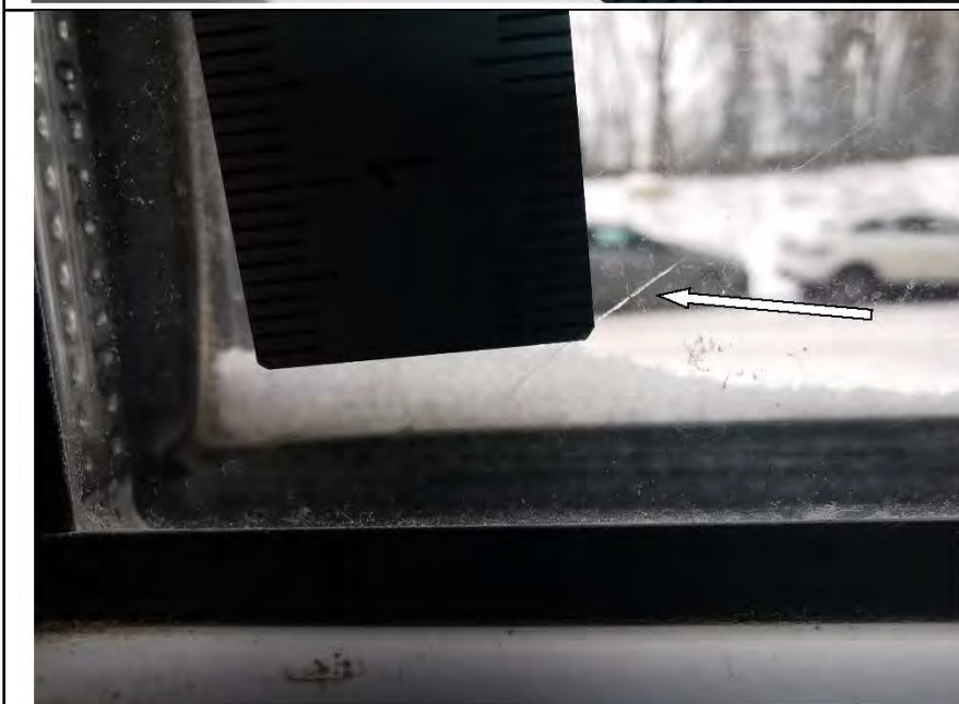
Фото №62. Царапины на стеклопакете оконного блока ПВХ в на кухне.
