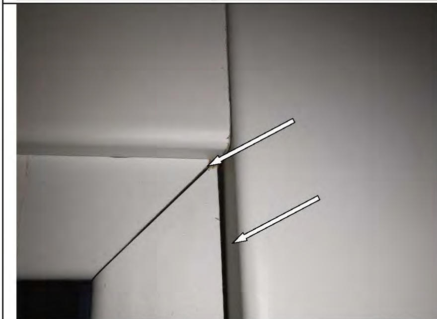
Фото №59. Элементы дверного блока (короба) соединены не надежно в спальне.
