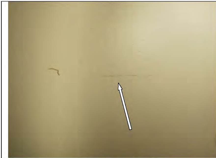
Фото №52. Царапины на полотне деревянного дверного блока в кухне.
