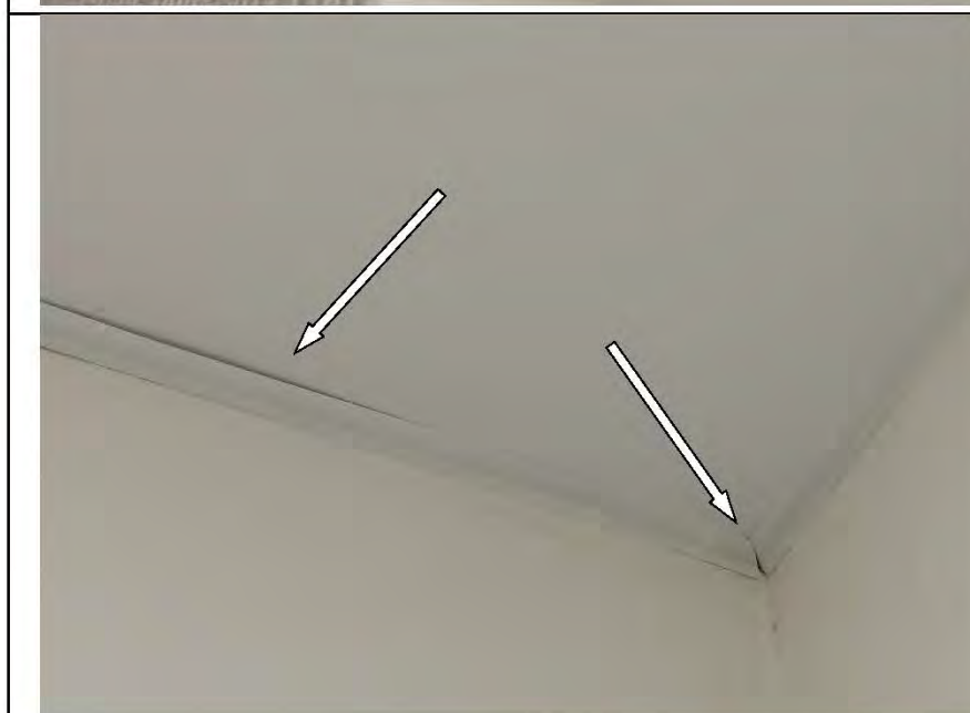
Фото №36. Дефект монтажа декоративного молдинга крепления натяжного потолка в коридоре.
