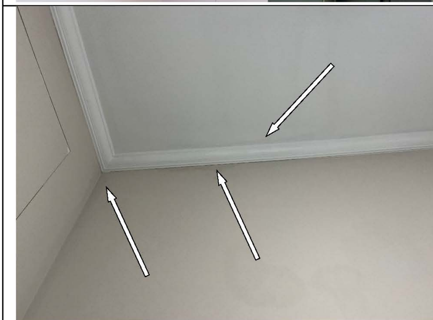
Фото №15. Видимые следы залива на поверхности стен и образования плесени в коридоре. Видимые следы залива на поверхности потолка в коридоре.
