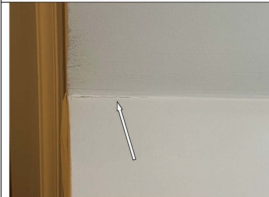
Фото №23. Трещина по отколу оконного блока ПВХ в гостиной.
