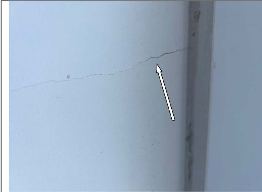
Фото №25. Трещина по откосу оконного блока ПВХ в спальне.
