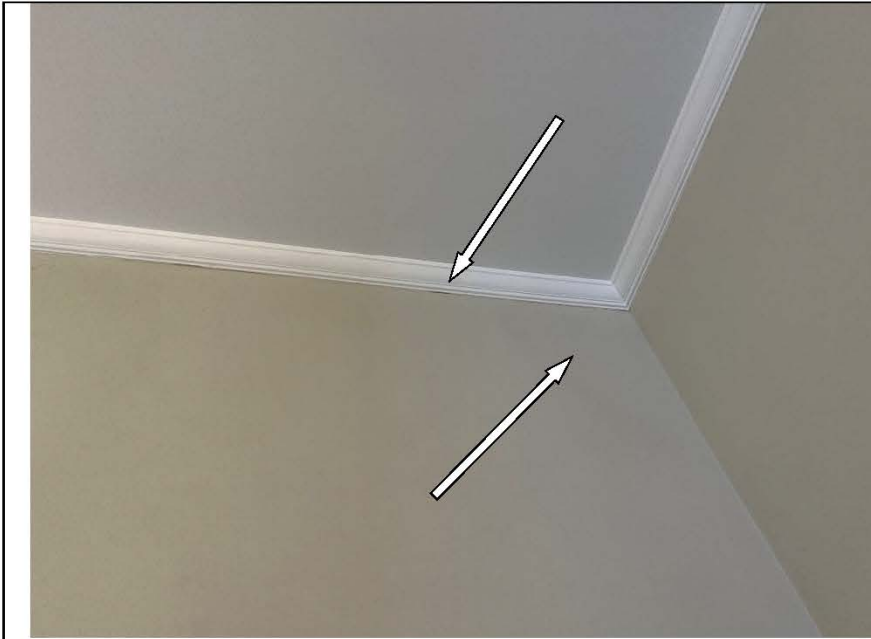
Фото №16. Видимые следы залития на поверхности стен и образования плесени в детской.
