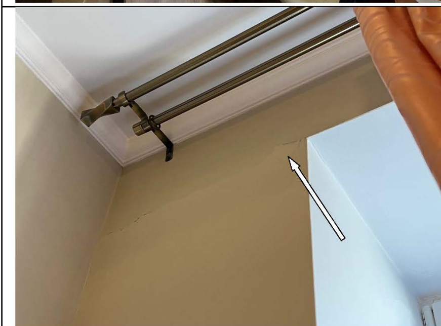
Фото №11. Отслоение отделочного покрытия на стенах в спальне.
