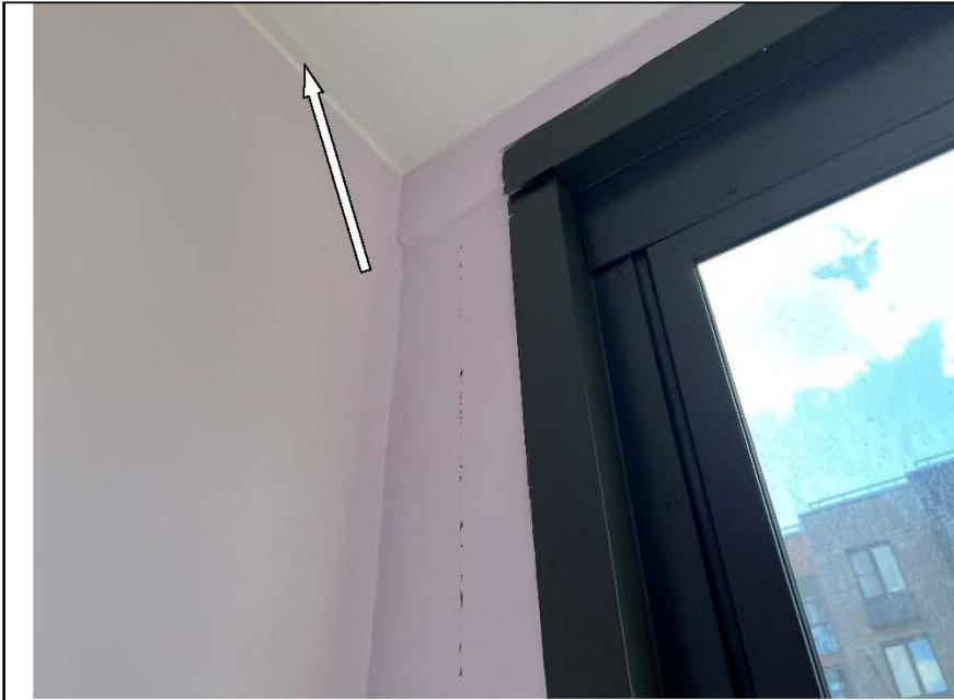
Фото №22. Видимые следы залития на поверхности потолка на лоджии.
