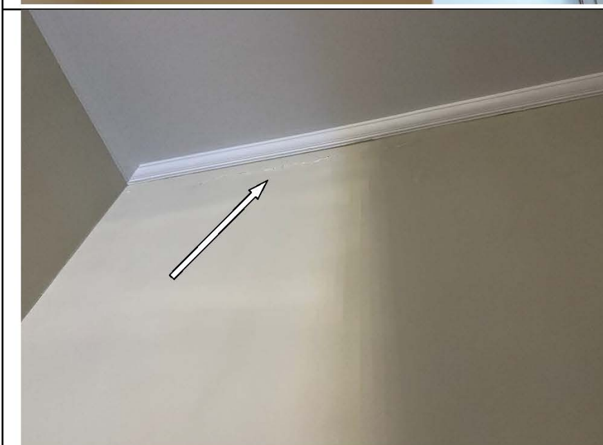
Фото №12. Отслоение отделочного покрытия на стенах в детской.
