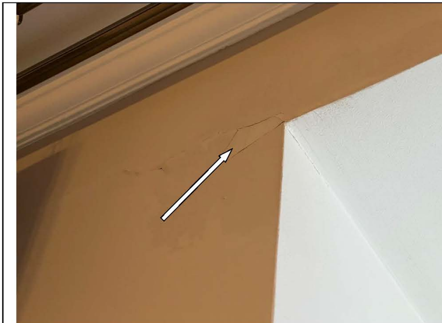
Фото №13. Отслоение отделочного покрытия на стенах в детской.
