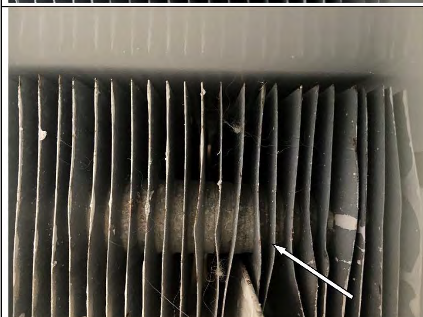
Фото №89. Загиб радиатора в спальне.
