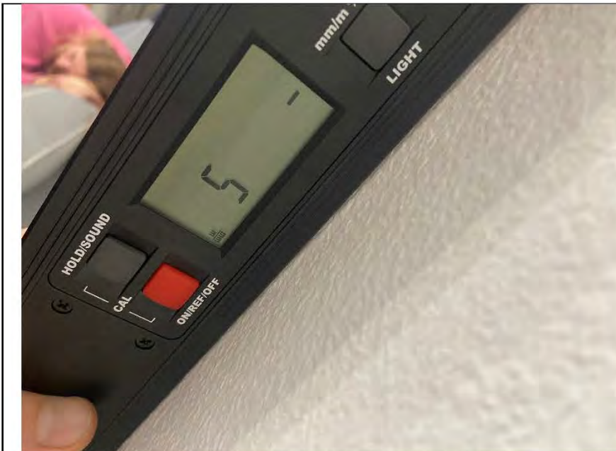
Фото №10. Отклонение поверхности стен от вертикали в кухне.
