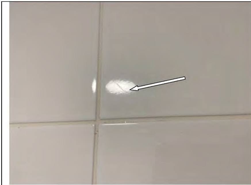
Фото №16. Загрязнения на настенной керамической плитке в санузле.
