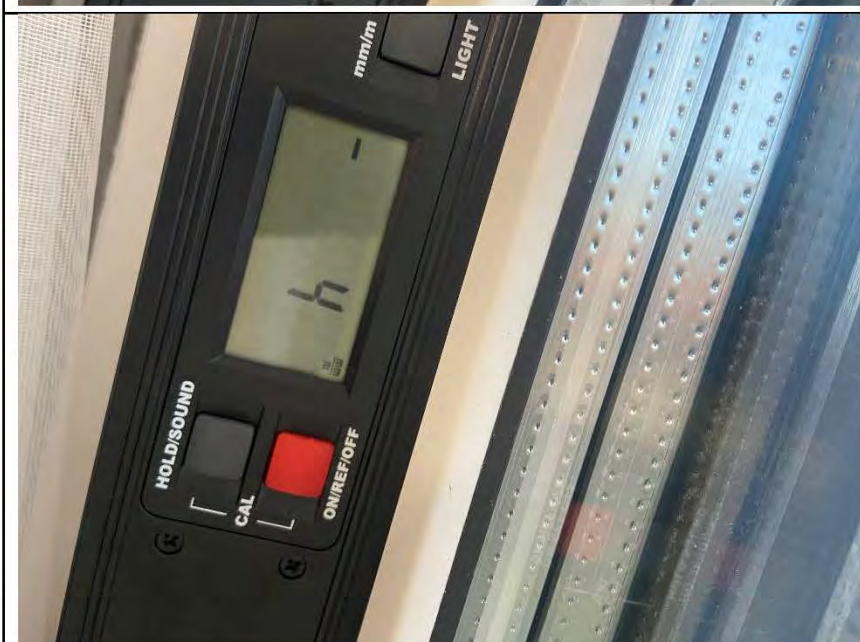
Фото №56. Отклонение от вертикали оконного блока ПВХ в спальне.
