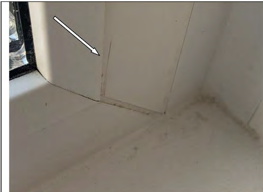
Фото №46. Загрязнения на профиле оконного блока ПВХ в детской.
