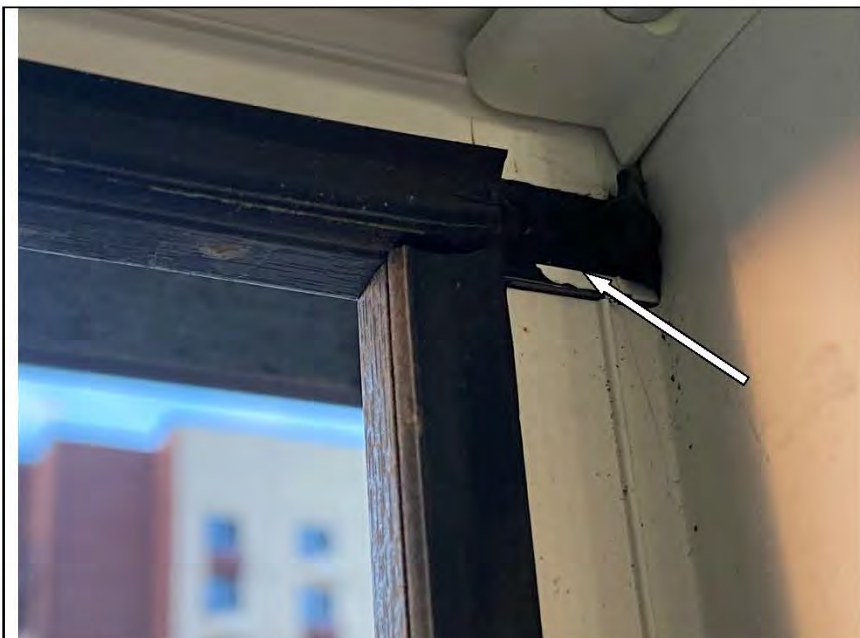
Фото №58. Дефект на уплотнительной ленте оконного блока ПВХ в детской.
