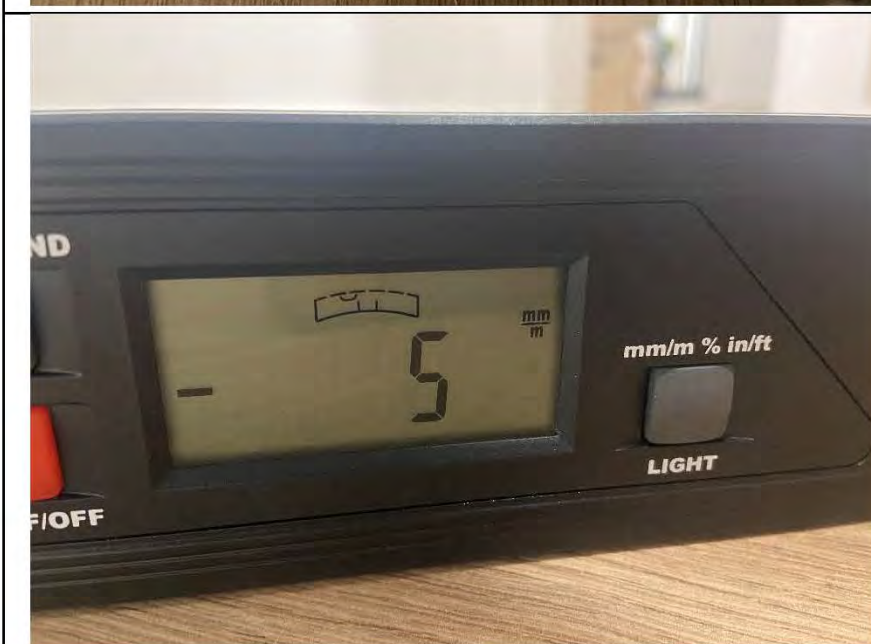
Фото №23. Отклонение поверхности напольного покрытия из ламината в коридоре.
