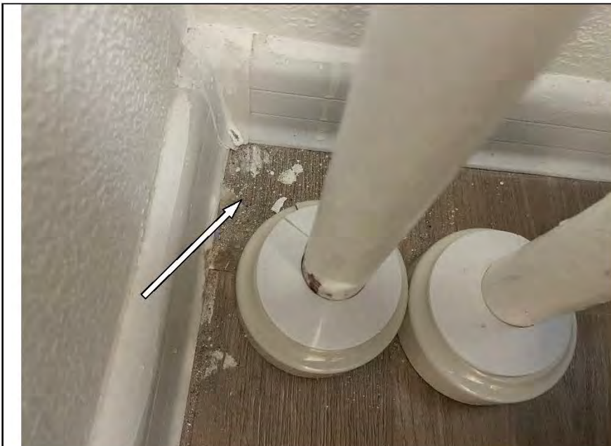
Фото №40. Дефект на напольном покрытии из ламината в детской.
