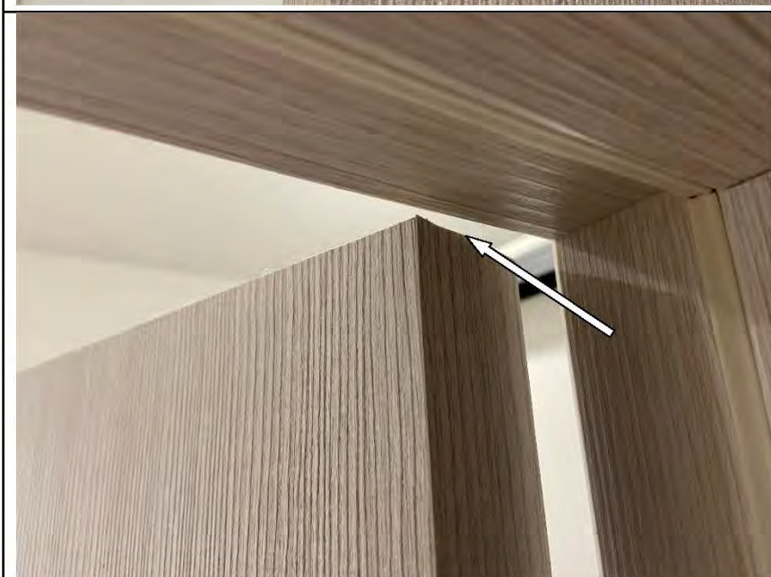
Фото №68. Дефект на полотне деревянного дверного блока в ванной комнате.
