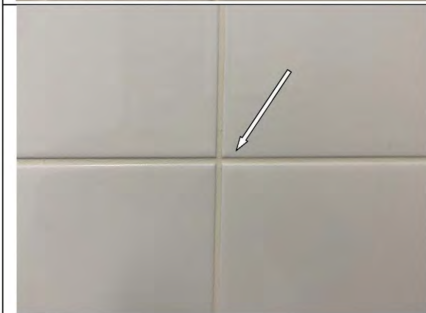
Фото №18. Неровные швы настенной керамической плитки в санузле.
