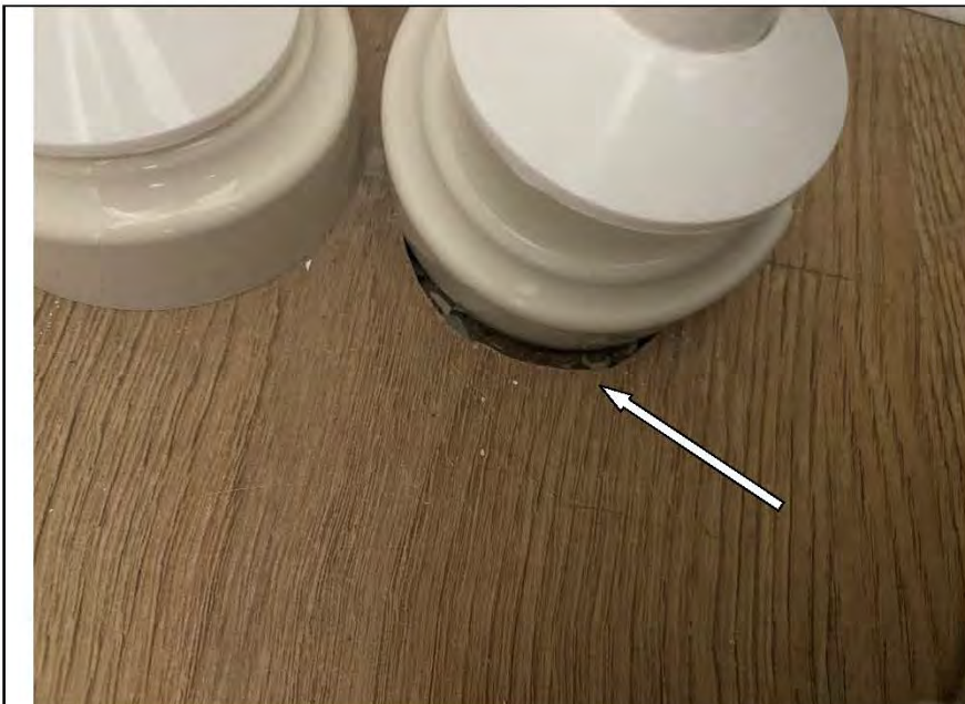
Фото №22. Коротко подрезан ламинат на стыке элементов в кухне.
