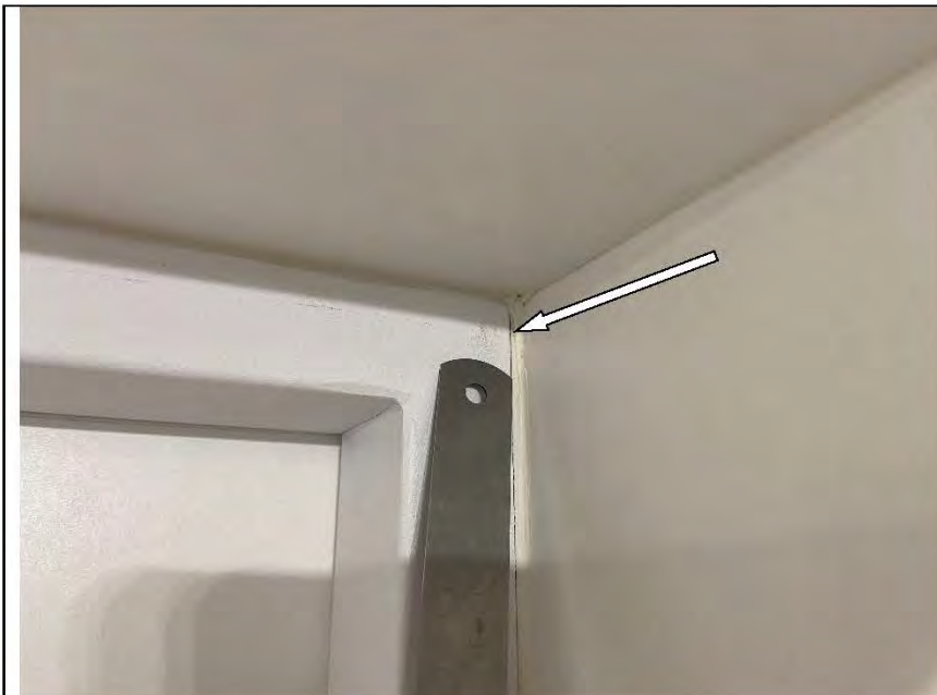
Фото №64. Дефект на коробке входного дверного блока в коридоре.
