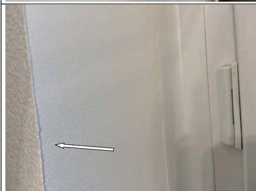
Фото №53. Неровности, выбоины, раковины на окрашенных откосах оконного блока ПВХ в спальне.
