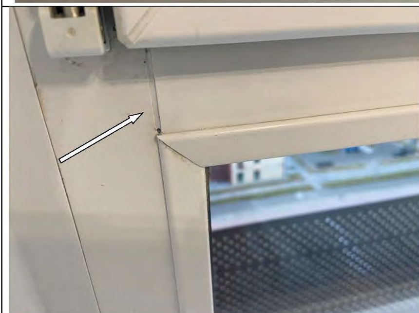
Фото №47. Загрязнения на профиле оконного блока ПВХ в спальне.
