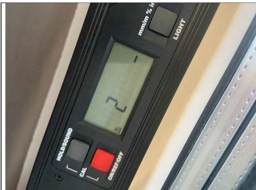
Фото №55. Отклонение от вертикали оконного блока ПВХ в детской.
