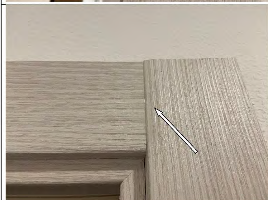
Фото №72. Дефект на наличниках деревянного дверного блока в ванной комнате.
