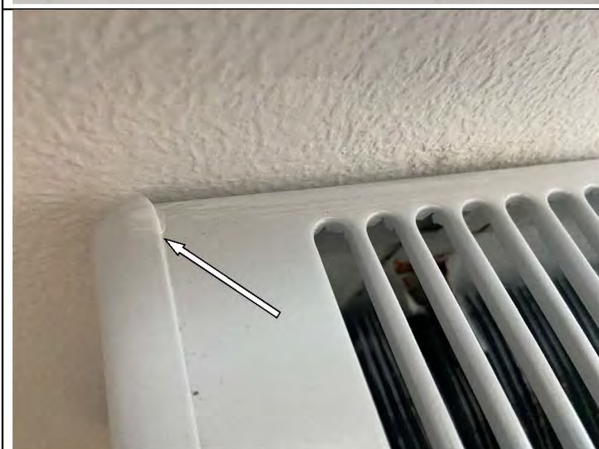
Фото №86. Дефект на поверхности металлического кожуха отопительного прибора в детской.
