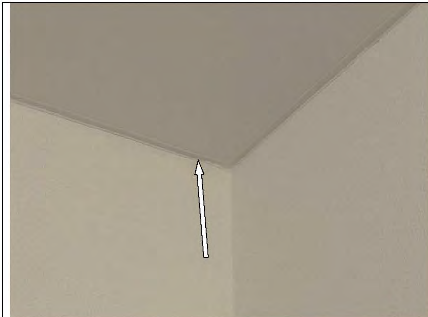
Фото №79. Дефект на поверхности натяжного потолка в коридоре.
