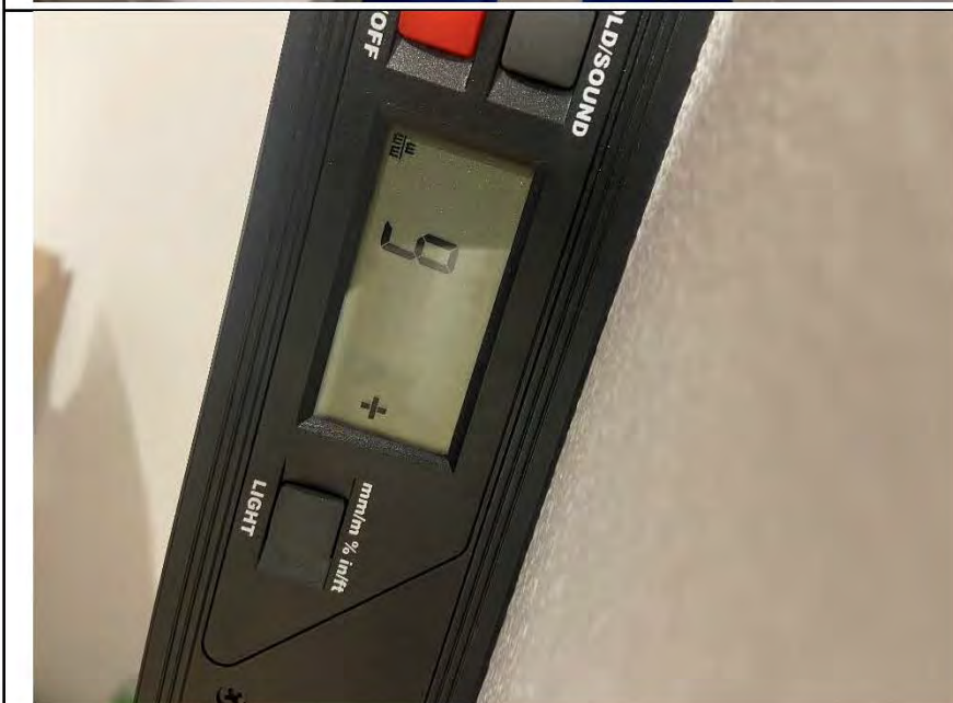
Фото №9. Отклонение поверхности стен от вертикали в коридоре.
