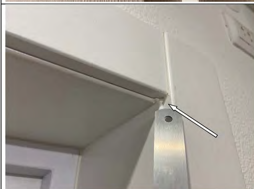
Фото №69. Дефект на наличниках входного дверного блока в коридоре.
