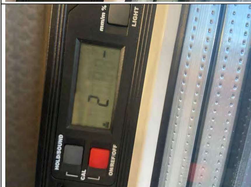
Фото №57. Отклонение от вертикали оконного блока ПВХ в кухне.
