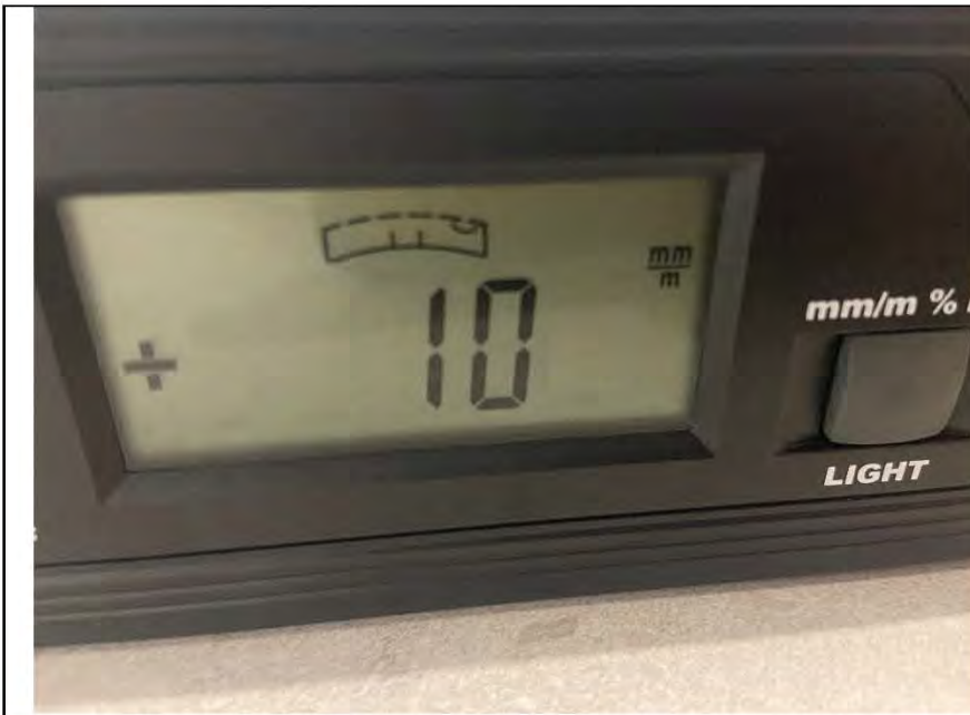
Фото №28. Отклонение поверхности напольного покрытия из керамической плитки в санузле.
