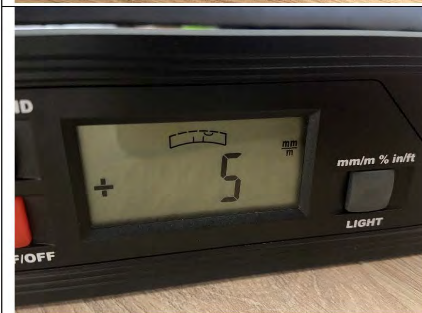
Фото №24. Отклонение поверхности напольного покрытия из ламината в детской.
