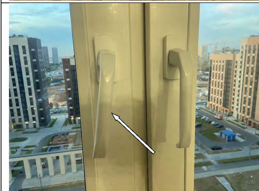
Фото №42. Не отрегулирована фурнитура оконного блока ПВХ в кухне.
