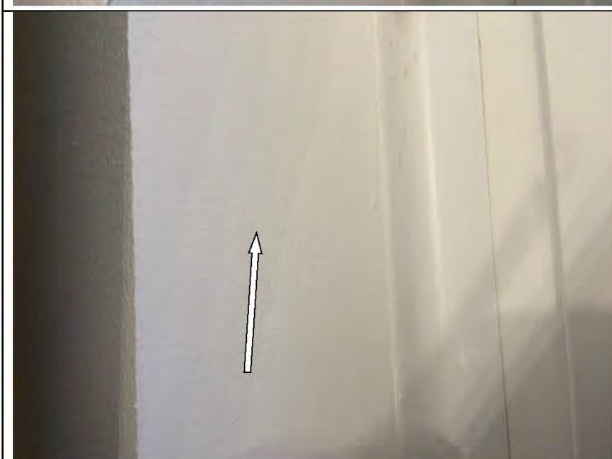
Фото №54. Неровности, выбоины, раковины на окрашенных откосах оконного блока ПВХ в кухне.
