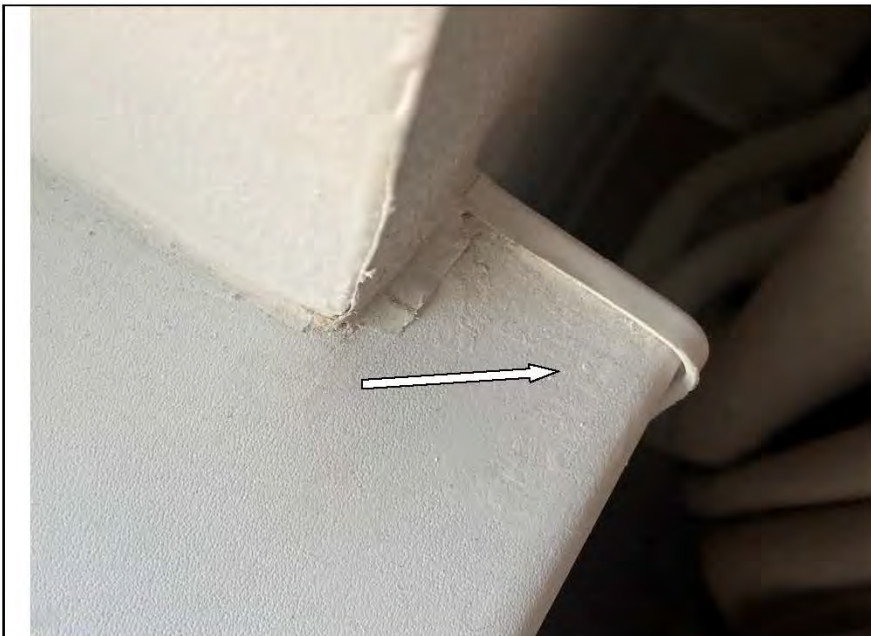
Фото №43. Дефект на лицевой стороне подоконной доски оконного блока ПВХ в детской.
