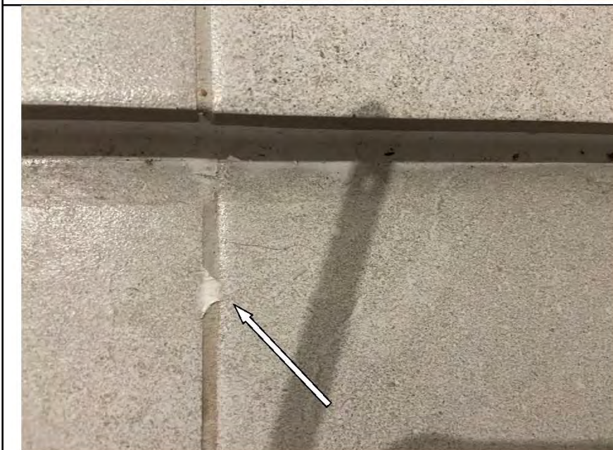
Фото №29. Загрязнения на напольной керамической плитке в ванной комнате.
