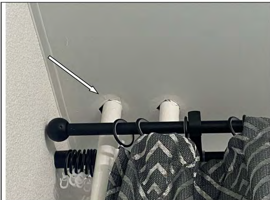
Фото №82. Дефект на поверхности натяжного потолка в спальне.
