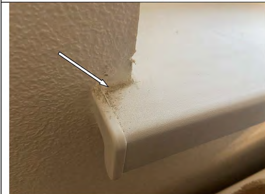
Фото №44. Дефект на лицевой стороне подоконной доски оконного блока ПВХ в спальне.
