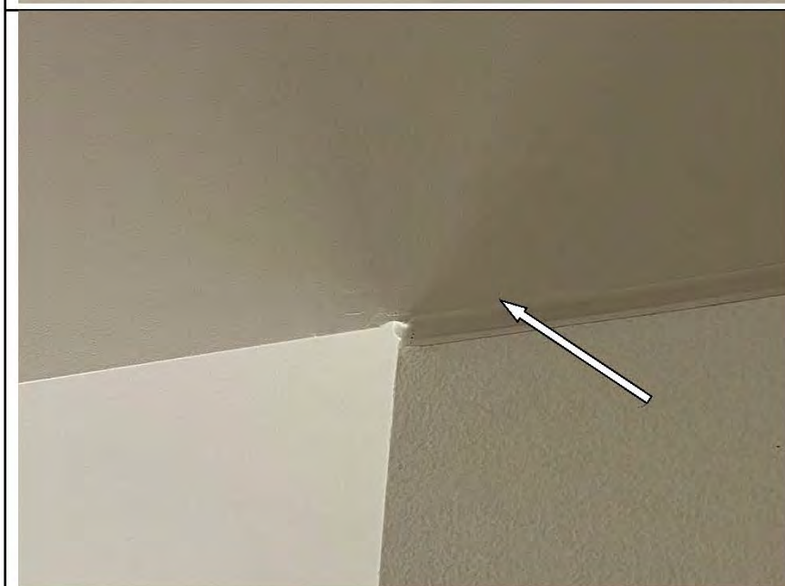
Фото №80. Дефект на поверхности натяжного потолка в коридоре.
