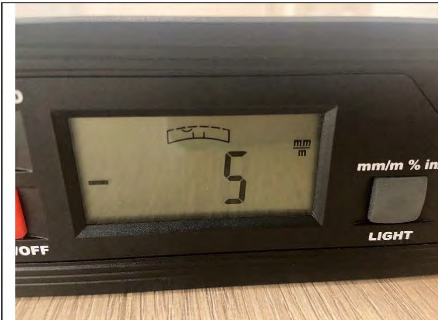
Фото №25. Отклонение поверхности напольного покрытия из ламината в спальне.
