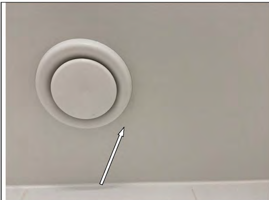
Фото №85. Дефект на поверхности подвесного потолка в санузле.
