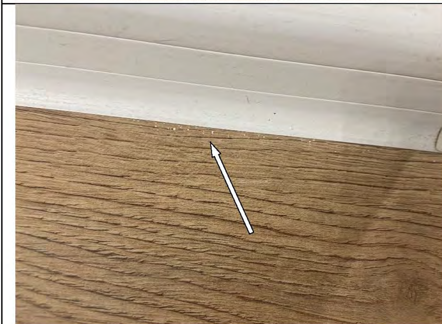
Фото №41. Дефект на напольном покрытии из ламината в кухне.
