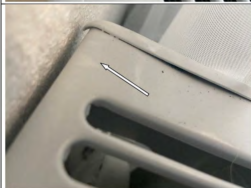
Фото №87. Дефект на поверхности металлического кожуха отопительного прибора в спальне.
