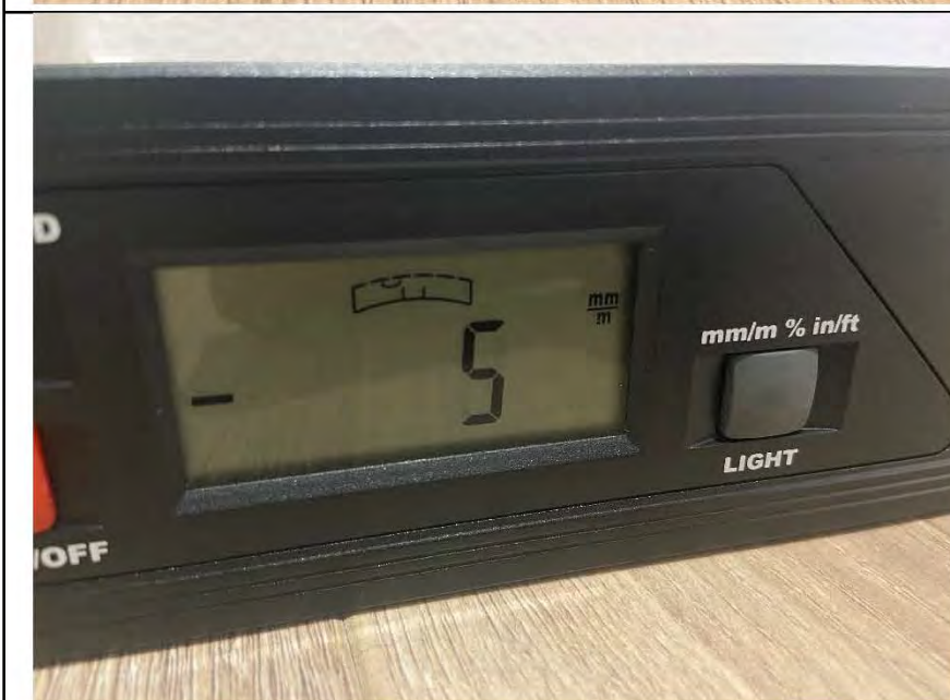
Фото №26. Отклонение поверхности напольного покрытия из ламината в кухне.
