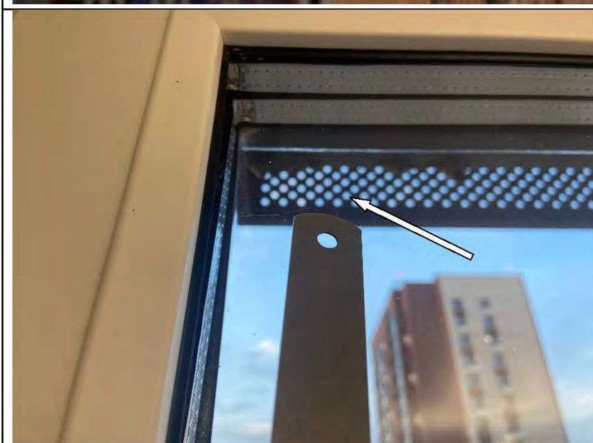
Фото №51. Царапина на стеклопакете оконного блока ПВХ в кухне.
