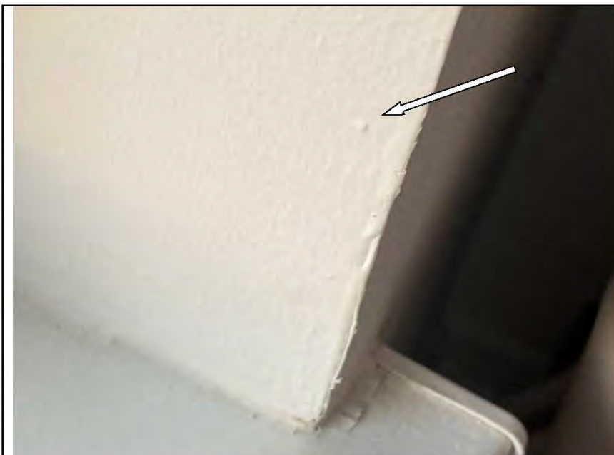
Фото №52. Неровности, выбоины, раковины на окрашенных откосах оконного блока ПВХ в детской.
