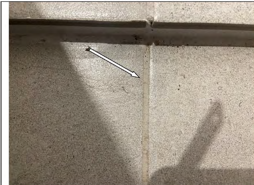
Фото №31. Неровные швы напольной керамической плитки в ванной комнате.
