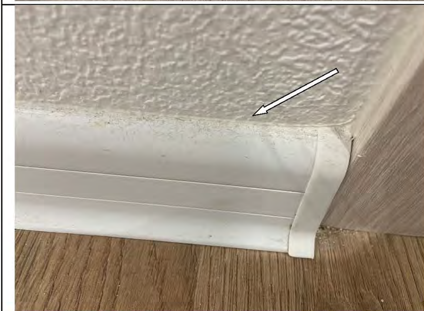
Фото №33. Дефект на напольном плинтусе ПВХ в коридоре.
