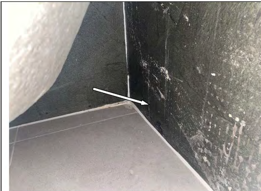
Фото №19. Частично отсутствует настенная керамическая плитка в ванной комнате.
