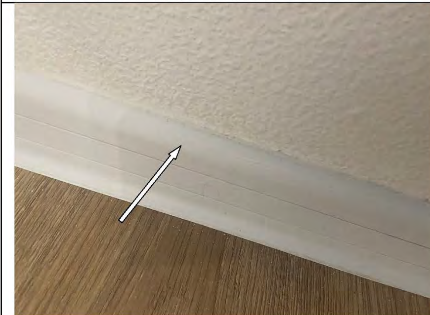
Фото №35. Дефект на напольном плинтусе ПВХ в детской.
