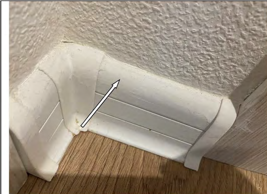
Фото №34. Дефект на напольном плинтусе ПВХ в коридоре.
