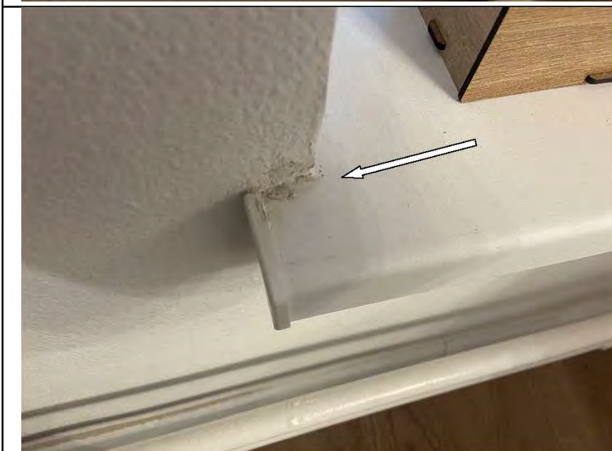
Фото №45. Дефект на лицевой стороне подоконной доски оконного блока ПВХ в кухне.
