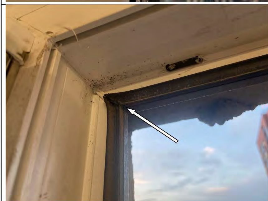
Фото №60. Дефект на уплотнительной ленте оконного блока ПВХ в кухне.
