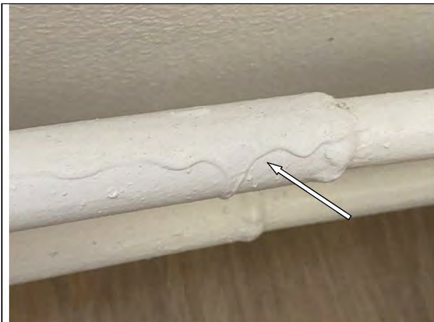
Фото №61. Неровности, подтеки, раковины на окрашенных трубах отопления в детской.
