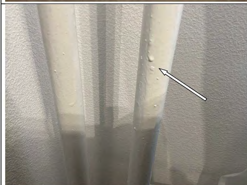
Фото №62. Неровности, подтеки, раковины на окрашенных трубах отопления в спальне.
