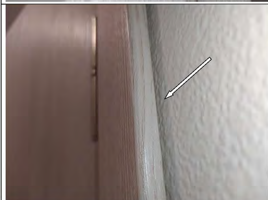
Фото №23. Неплотное прилегание дверного наличника к стене в ванной комнате.
