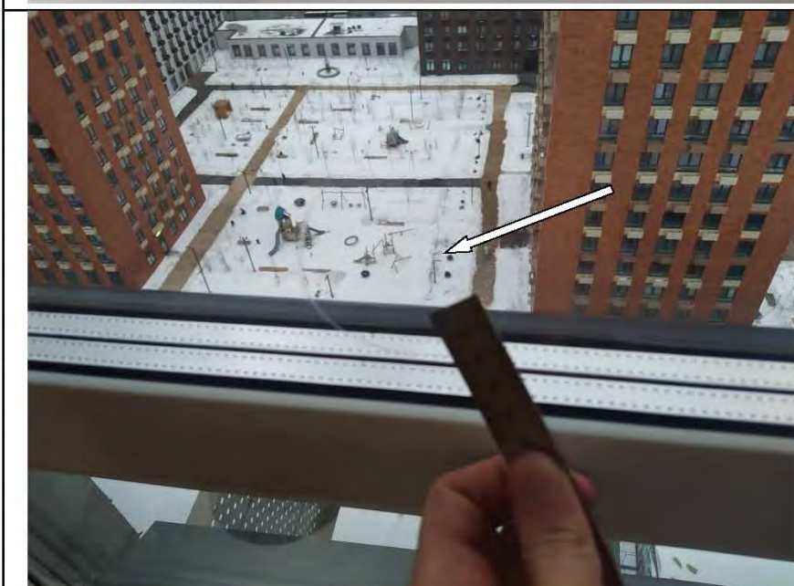
Фото №17. На стеклопакете оконного блока ПВХ в кухне-гостиной имеется дефект (царапина)
