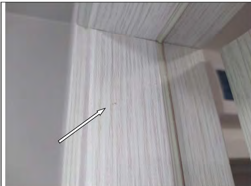
Фото №22. Коробка деревянного дверного блока в ванной комнате имеет дефекты (царапина).
