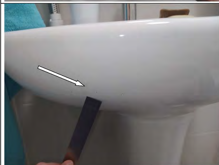
Фото №38. Окалины на раковине в ванной комнате
