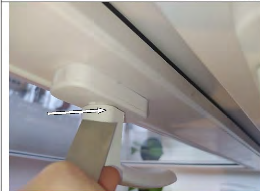
Фото №15. Скол на фурнитуре оконного блока ПВХ в кухне-гостиной (ручке).
