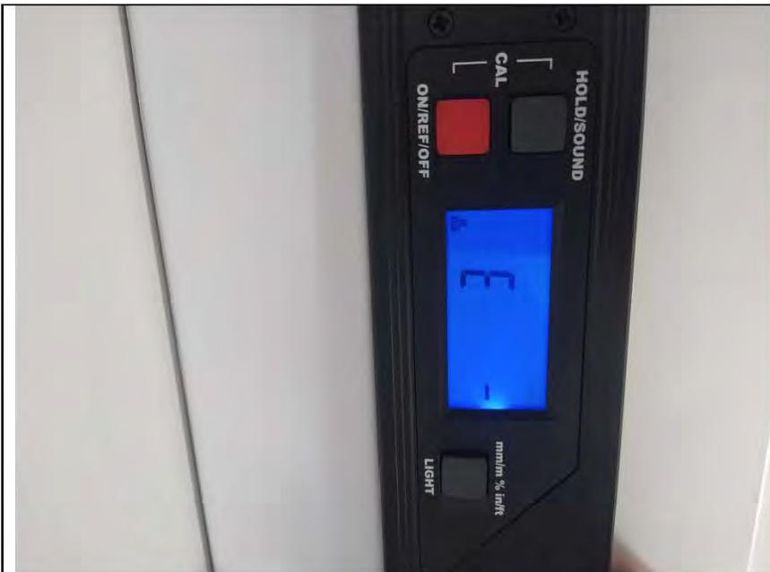
Фото №34. Отклонение коробки входного дверного блока
