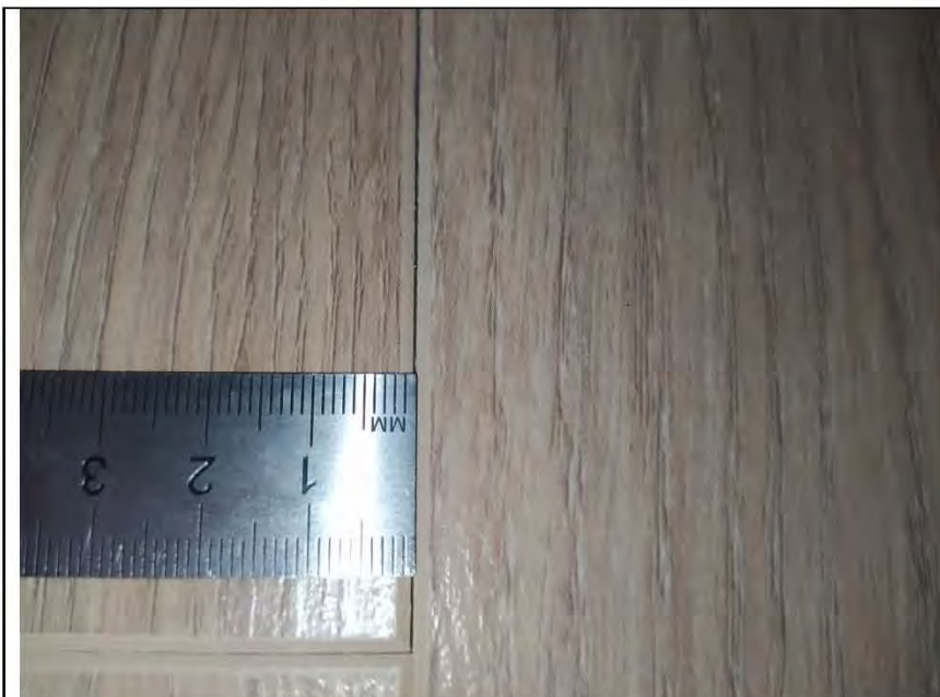
Фото №31. Зазор между соседними досками ламината в кухне- гостиной.
