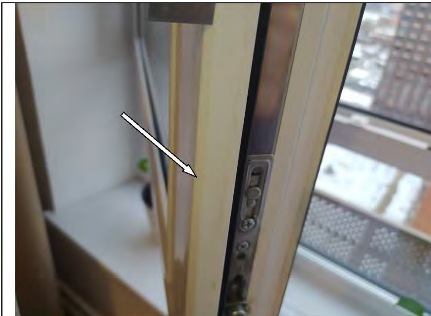
Фото №13. Профиль ПВХ оконного блока в кухне-гостиной имеет дефекты (механические повреждения).
