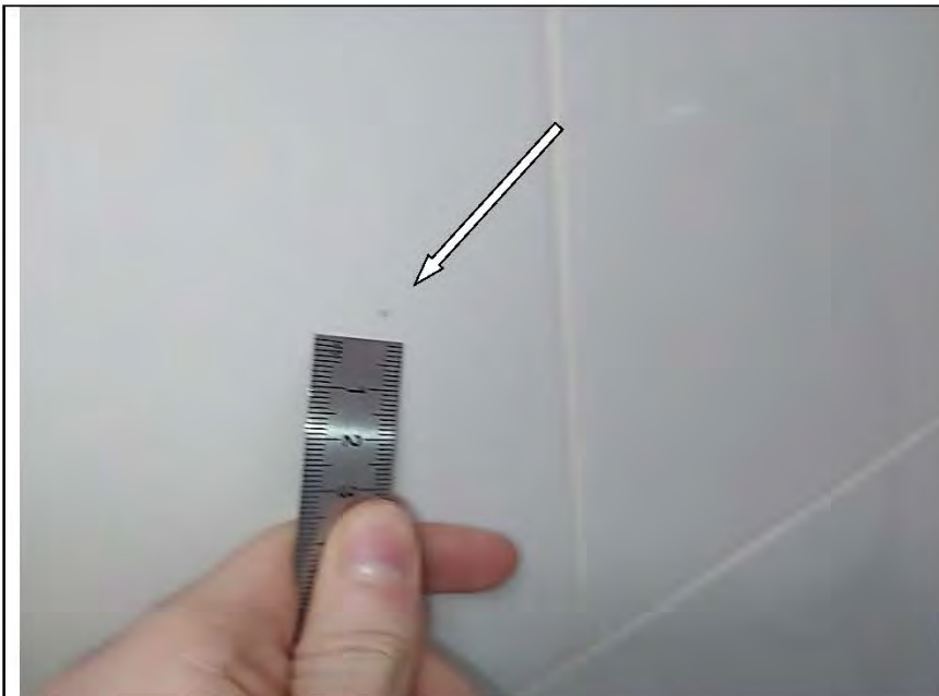
Фото №28. Окалина на настенной керамической плитке в ванной комнате.
