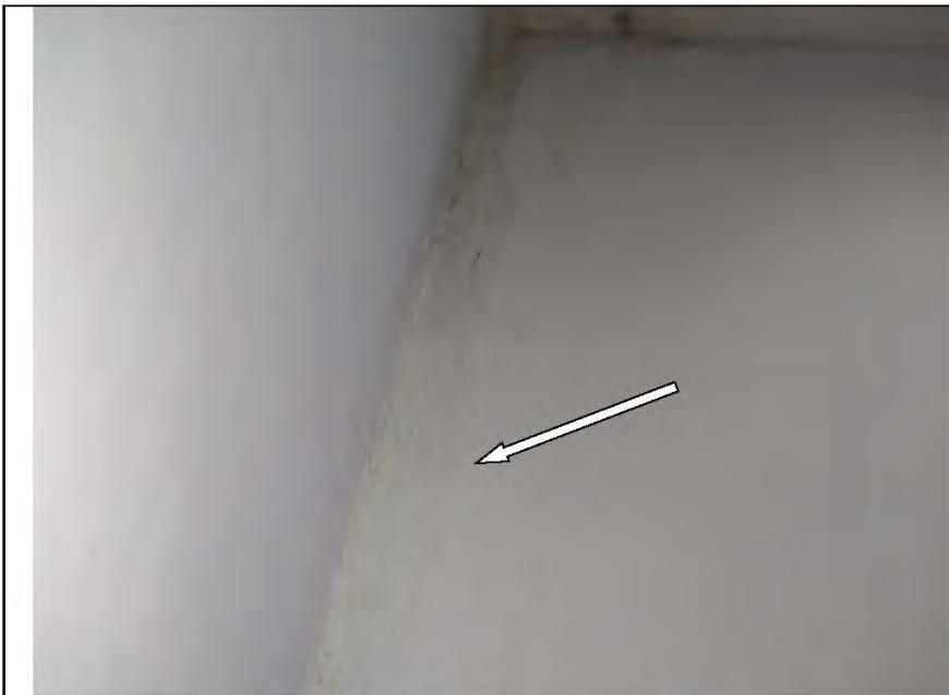
Фото №16. На лицевой поверхности подоконной доски в кухне-гостиной имеются дефекты (загрязнение строительными составами).
