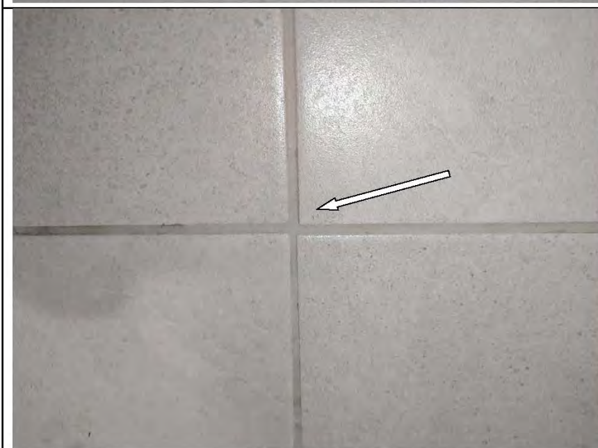
Фото №30. Затирка напольной плитки выполнена с нарушениями в прихожей: разность ширины шва.
