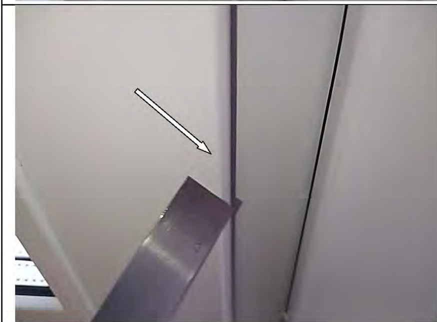
Фото №12. Профиль ПВХ оконного блока в кухне-гостиной имеет дефекты (скол).
