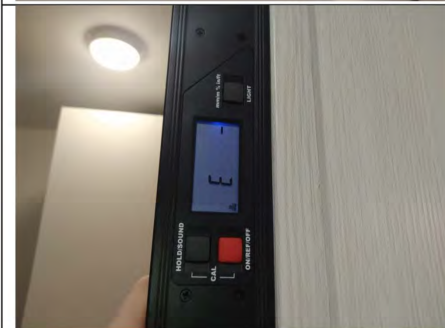
Фото №21. Отклонение коробки дверного блока в ванной комнате.
