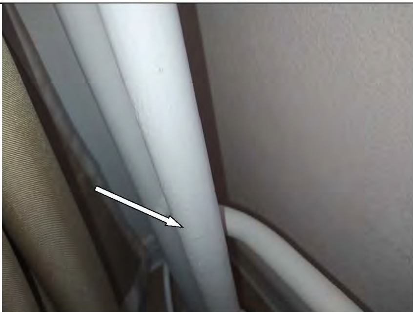
Фото №36. Окрашивание труб отопления выполнено с дефектами в кухне- гостиной (подтеки)
