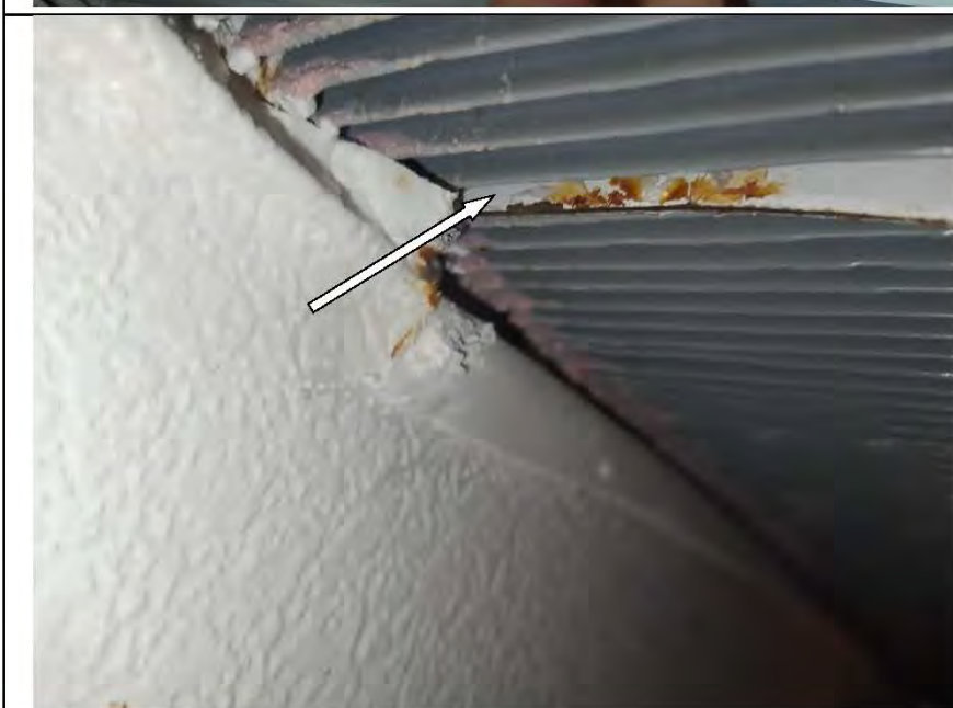
Фото №18. Радиатор в кухне-гостиной имеет дефекты (коррозия).
