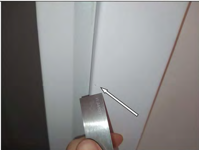
Фото №35. Коробка входной металлической двери имеет дефекты (сколы).
