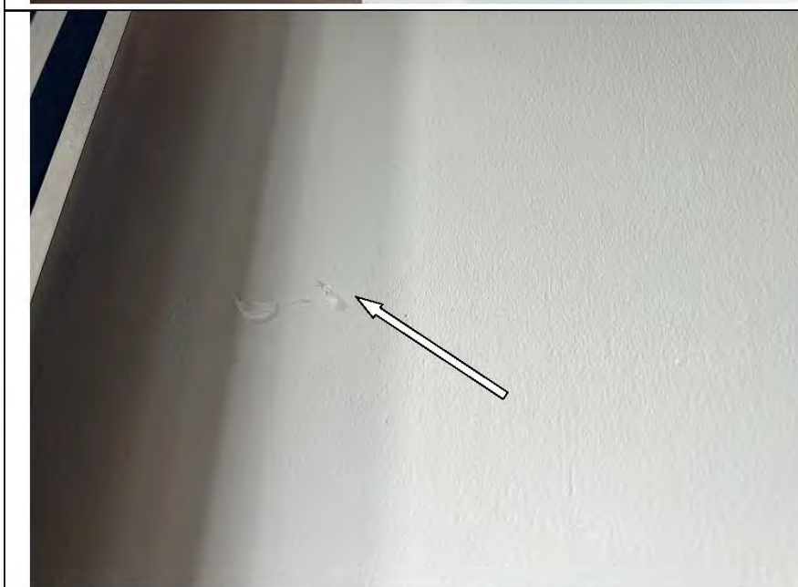
Фото №51. Подтеки краски на откосах оконного блока ПВХ в кухне.
