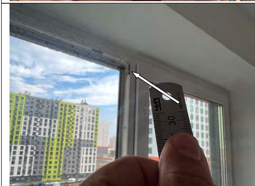
Фото №62. Царапина на стеклопакете оконного блока ПВХ в спальне.
