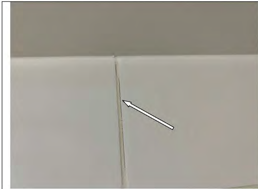
Фото №31. Трещина затирочного раствора в шовном пространстве настенной керамической плитки в санузле.
