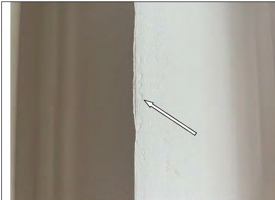
Фото №52. Подтеки краски на откосах оконного блока ПВХ в детской.
