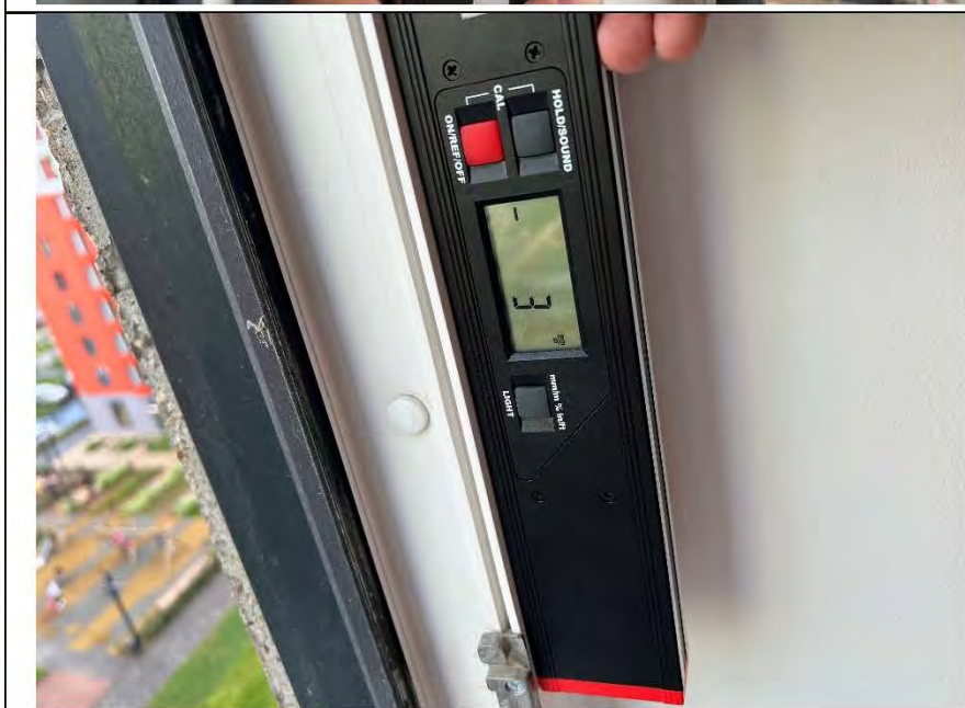
Фото №78. Отклонение оконного блока ПВХ в гостиной составляет 3 мм.
