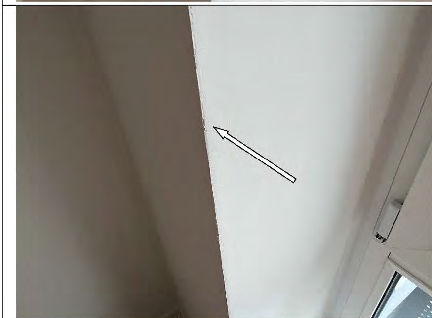
Фото №53. Подтеки краски на откосах оконного блока ПВХ в спальне.
