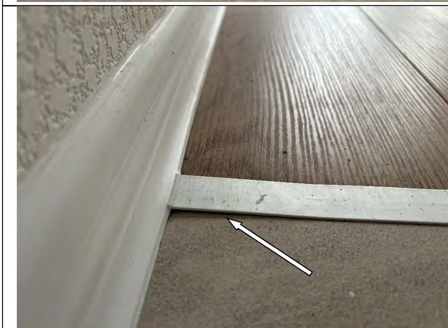
Фото №113. Щель в стыке металлического порога и поверхности напольной керамической плитки.
