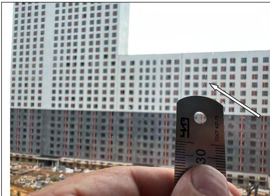
Фото №61. Царапина на стеклопакете оконного блока ПВХ в детской.
