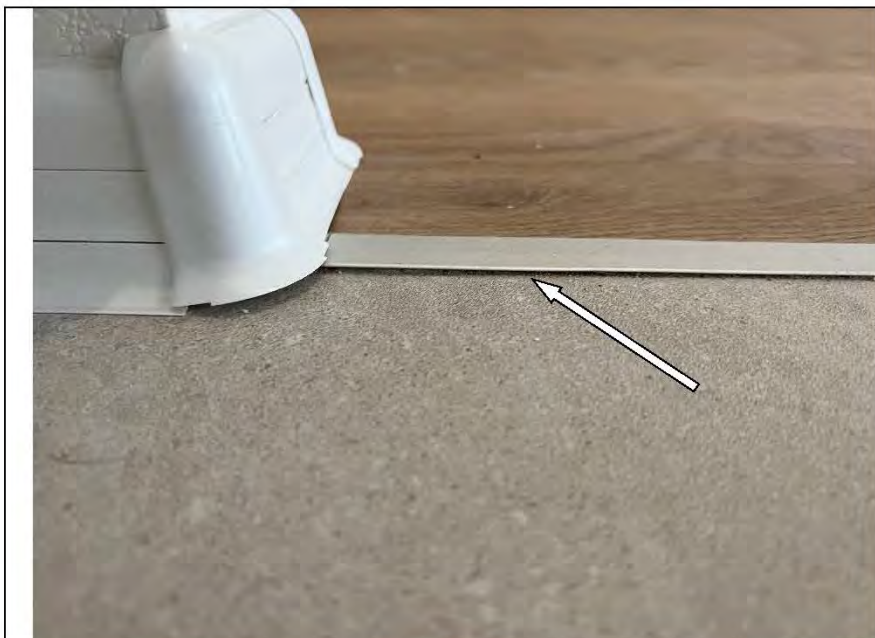
Фото №112. Щель в стыке металлического порога и поверхности напольной керамической плитки.
