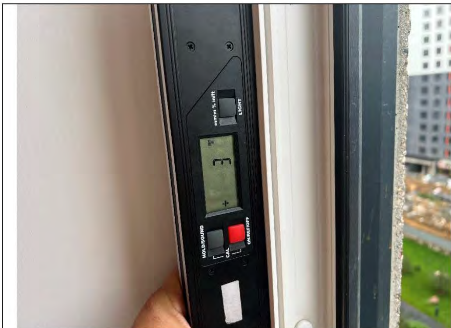
Фото №76. Отклонение оконного блока ПВХ в кухне составляет 3 мм.
