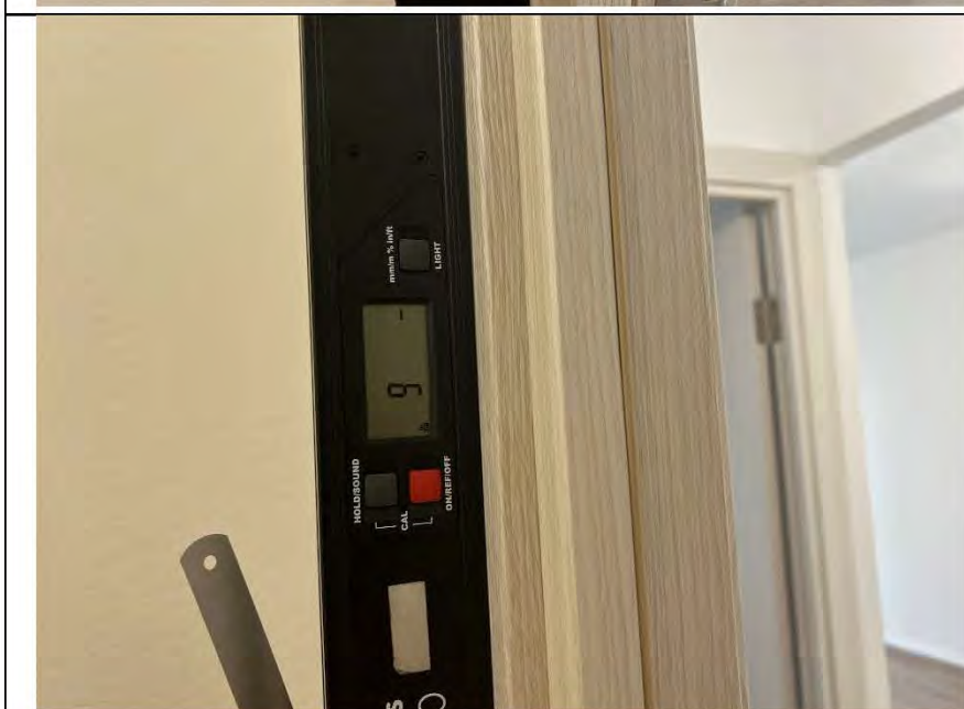
Фото №89. Отклонение наличников дверного блока в гардеробной составляет 6 мм.
