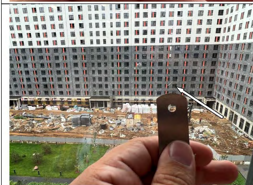
Фото №59. Царапина на стеклопакете оконного блока ПВХ в кухне.
