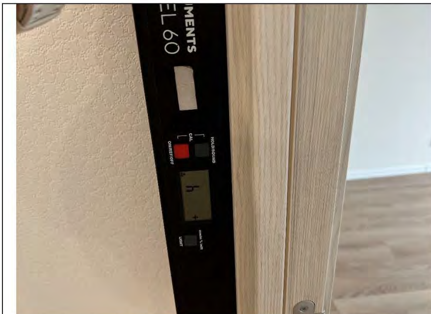
Фото №88. Отклонение наличников дверного блока в детской составляет 4 мм.
