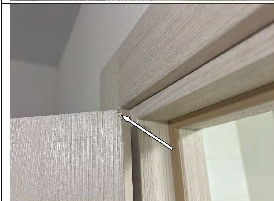
Фото №98. Замытие на ламинации лицевой поверхности полотна дверного блока в санузле.
