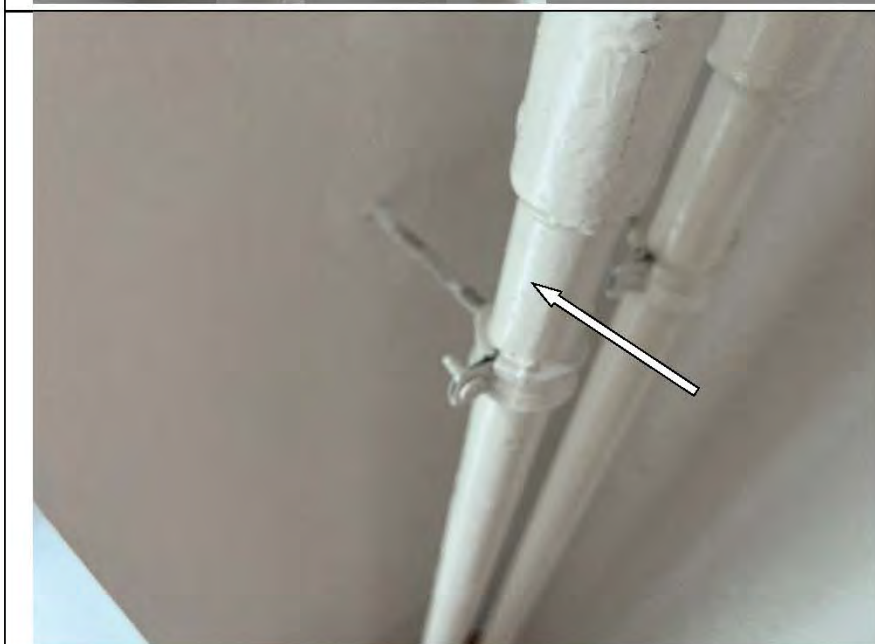
Фото №110. Подтеки краски на трубах отопления в спальне.
