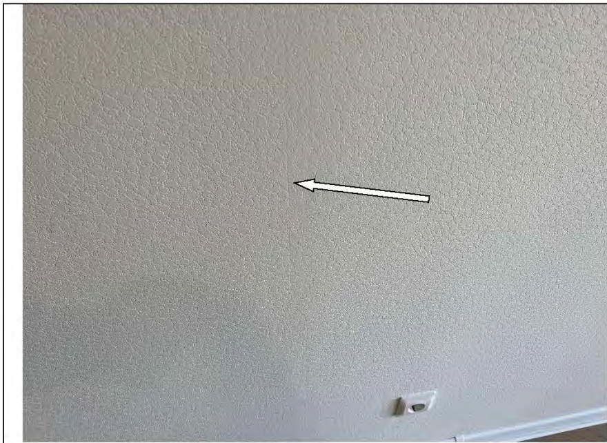
Фото №19. Читаемые обойные стыки в спальне.
