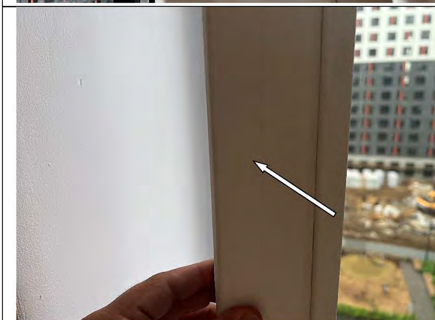
Фото №68. Царапина на профиле ПВХ оконного блока в кухне.
