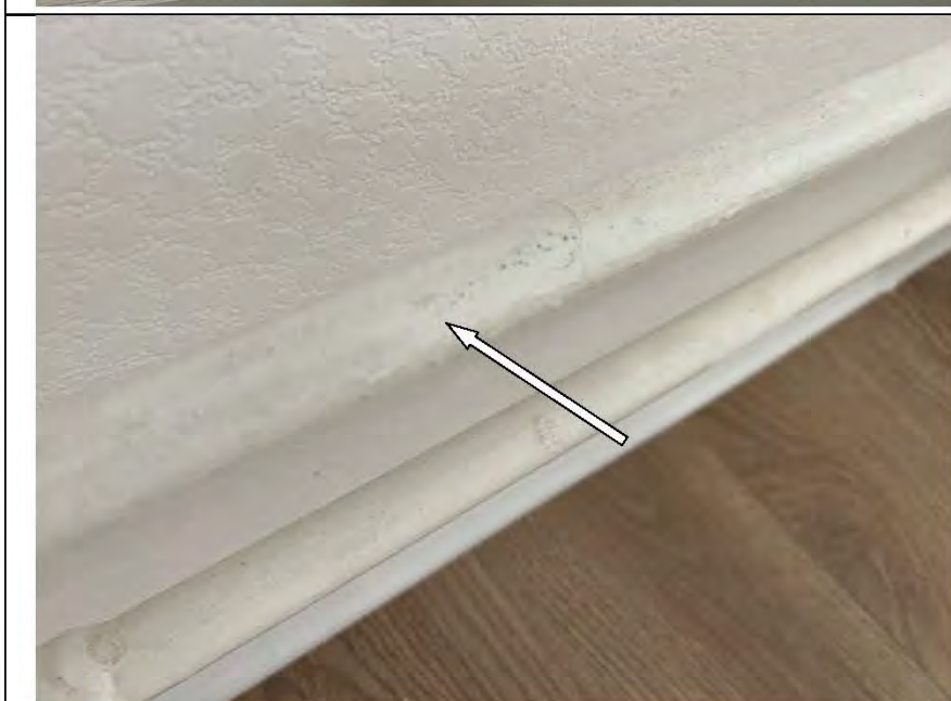
Фото №108. Подтеки краски на трубах отопления в кухне.
