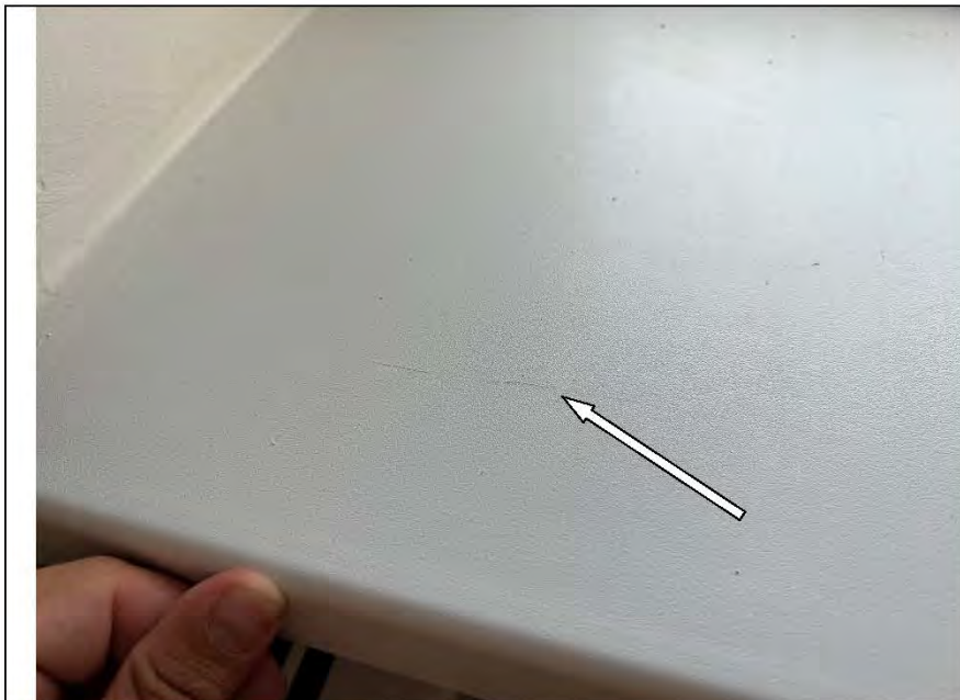
Фото №49. Царапина на лицевой поверхности подоконной доски в гостиной.
