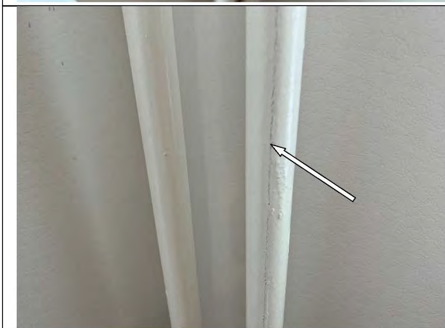
Фото №111. Подтеки краски на трубах отопления в гостиной.
