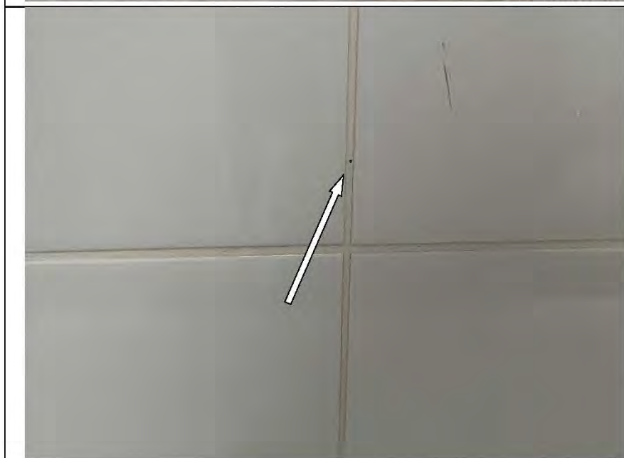
Фото №33. Каверны затирочного раствора в шовном пространстве настенной керамической плитки в ванной комнате.
