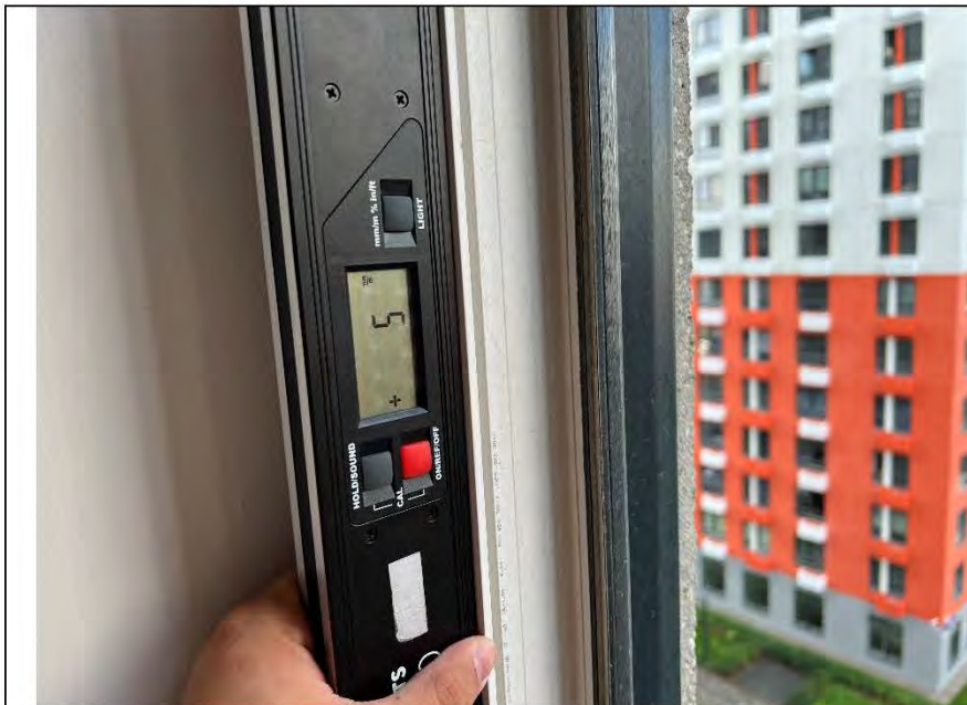
Фото №79. Отклонение оконного блока ПВХ в гостиной составляет 5 мм.
