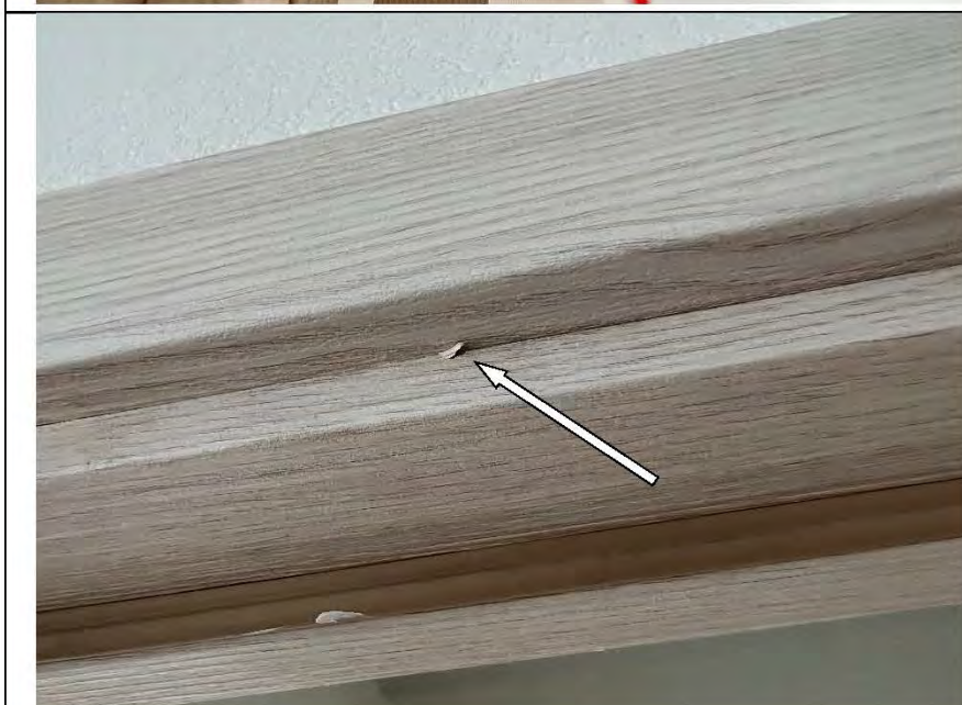
Фото №107. Сколы на коробке дверного блока в гостиной.
