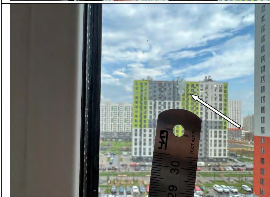
Фото №65. Производственный дефект на стеклопакете оконного блока ПВХ в спальне.
