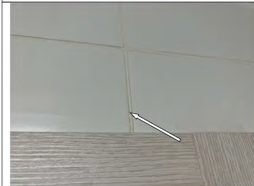
Фото №32. Трещина затирочного раствора в шовном пространстве настенной керамической плитки в ванной комнате.
