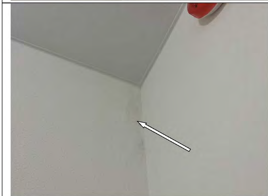
Фото №24. Загрязнение обойного полотна в гардеробной.
