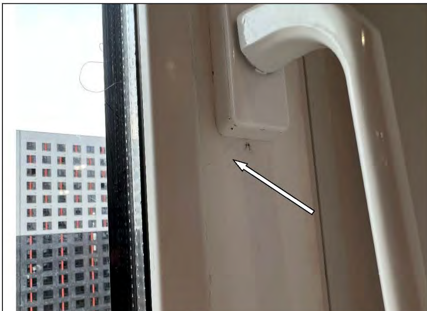
Фото №67. Царапина на профиле ПВХ оконного блока в кухне.
