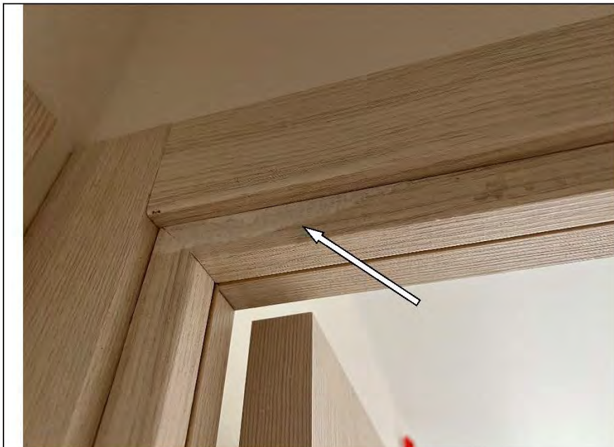
Фото №106. Загрязнение краской короба дверного блока в спальне.
