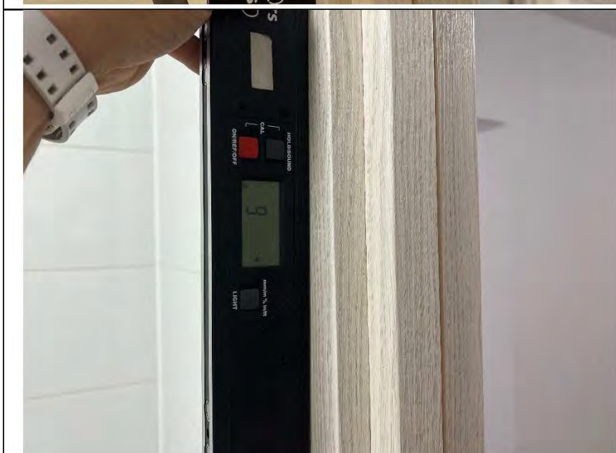
Фото №90. Отклонение наличников дверного блока в санузле составляет 6 мм.
