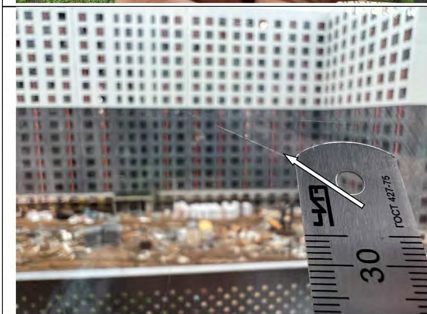
Фото №60. Царапина на стеклопакете оконного блока ПВХ в детской.
