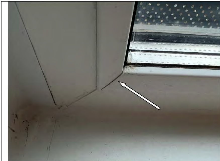
Фото №70. Зазоры в стыке профилей ПВХ оконного блока в детской.
