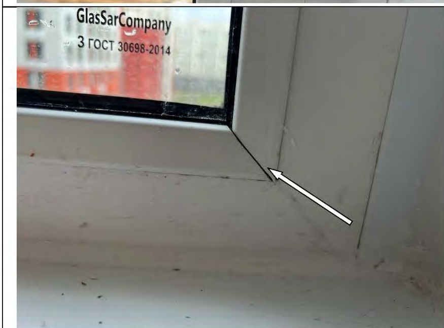
Фото №72. Зазоры в стыке профилей ПВХ оконного блока в спальне.
