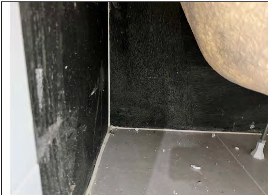
Фото №34. Отсутствует настенная керамическая плитка за ванной.
