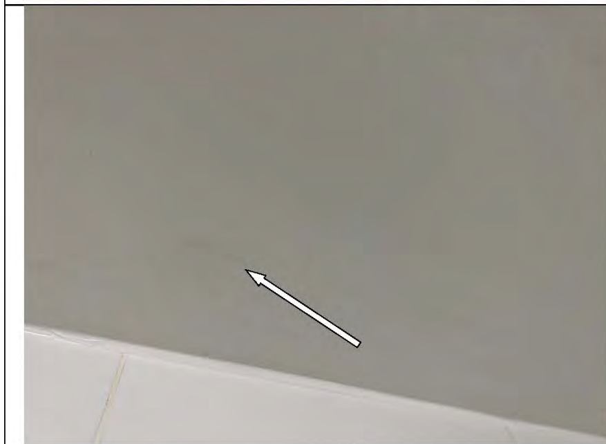
Фото №86. Загрязнение поверхности потолка в ванной комнате.
