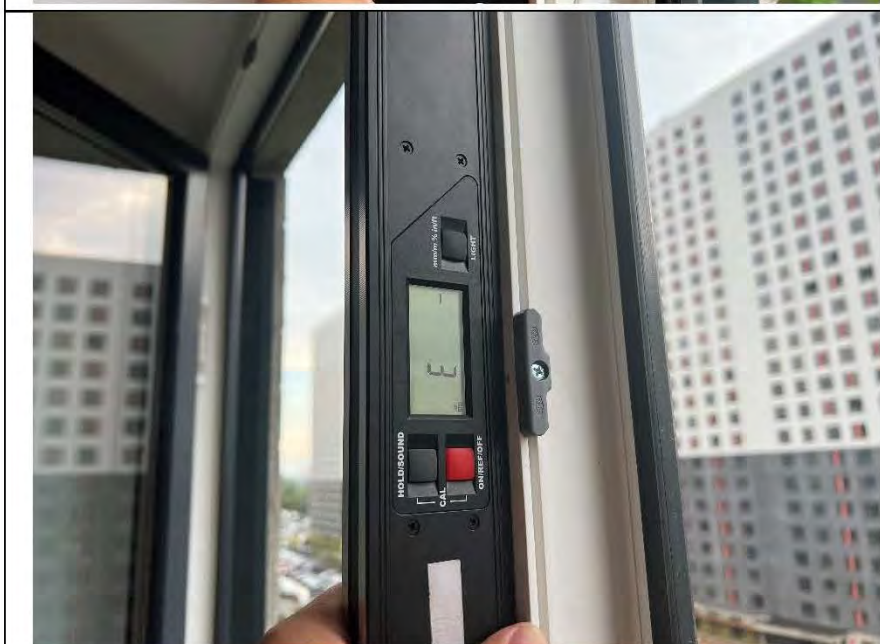
Фото №77. Отклонение оконного блока ПВХ в детской составляет 3 мм.
