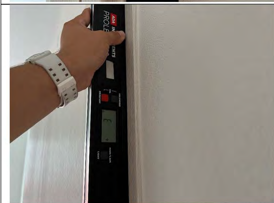
Фото №93. Отклонение наличников дверного блока в гостиной составляет 3 мм.
