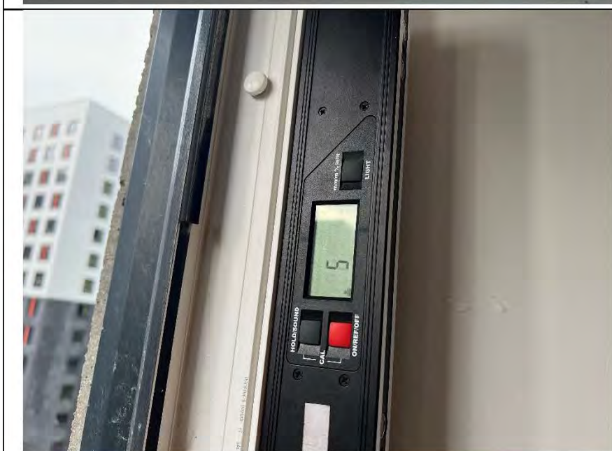
Фото №75. Отклонение оконного блока ПВХ в кухне составляет 5 мм.
