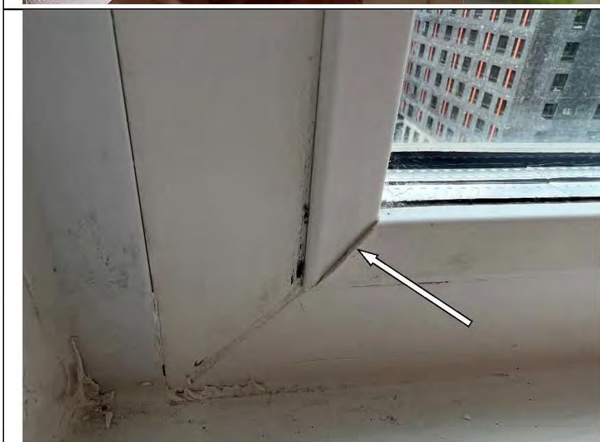
Фото №69. Зазоры в стыке профилей ПВХ оконного блока в кухне.
