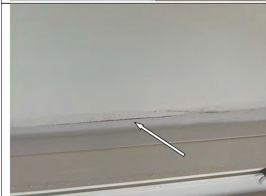
Фото №56. Трещина по откоосу оконного блока ПВХ в кухне.
