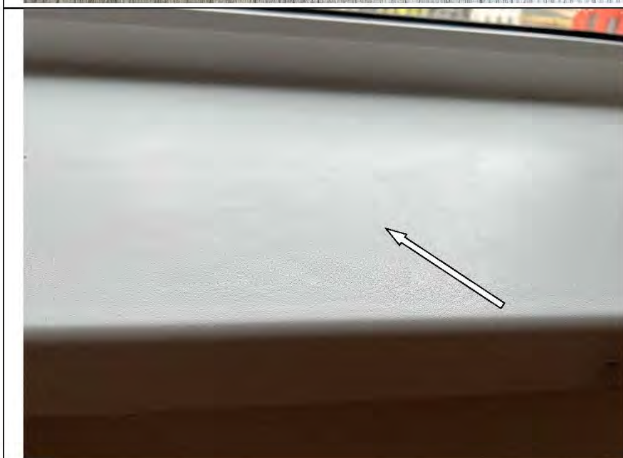
Фото №48. Царапина на лицевой поверхности подоконной доски в спальне.
