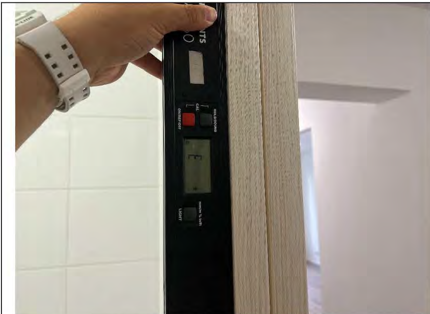
Фото №103. Отклонение коробки дверного блока в санузле от плоскостности и прямолинейности составляет 3 мм.
