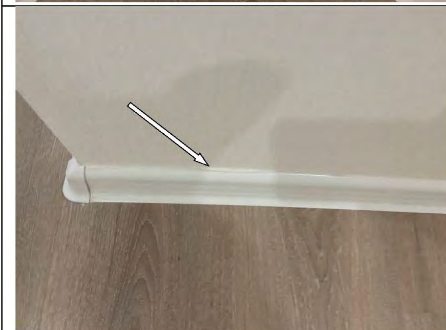
Фото №42. Дефект на напольном плинтусе ПВХ в гардеробной.
