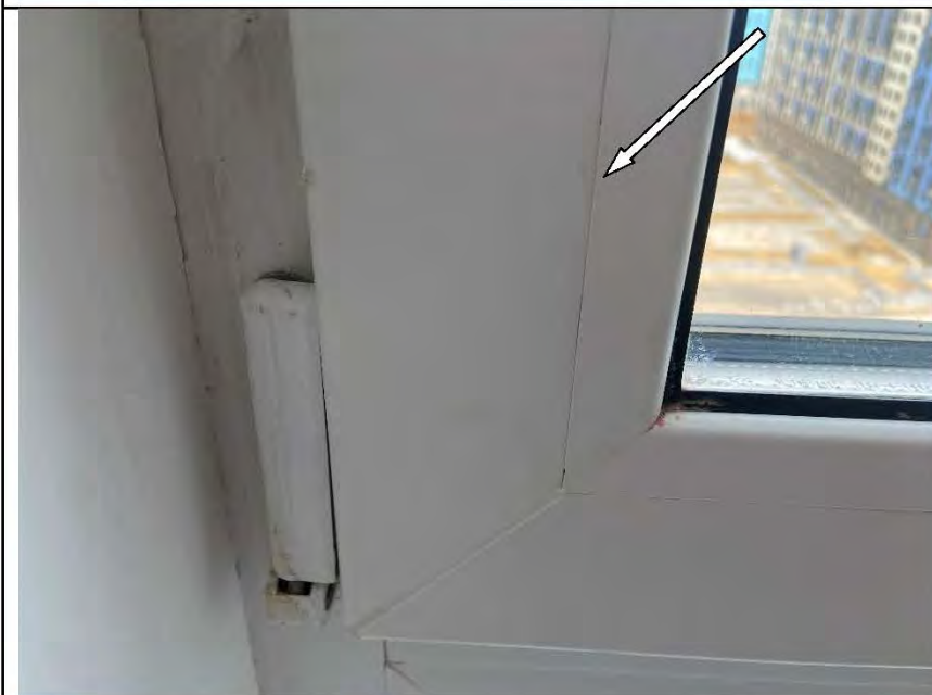
Фото №62. Дефект на профиле оконного блока ПВХ в кабинете.
