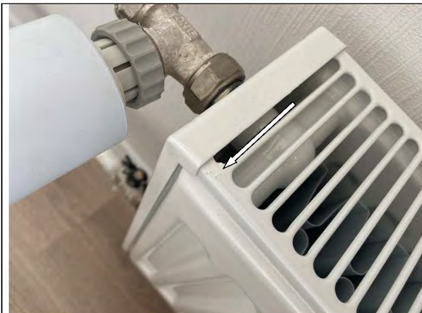
Фото №118. Дефект на металлическом кожухе отопительного прибора в спальне.
