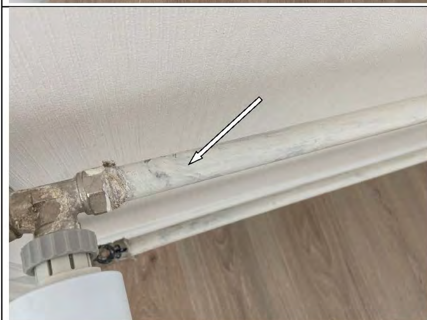
Фото №84. Неровности, подтеки на окрашенных трубах отопления в кабинете.
