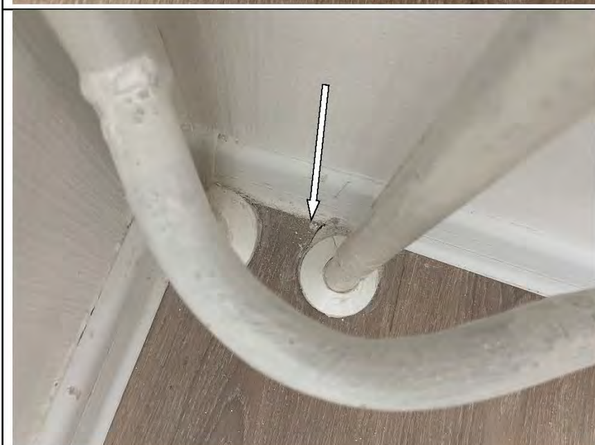
Фото №48. Дефект на напольном покрытии из ламината в кухне.
