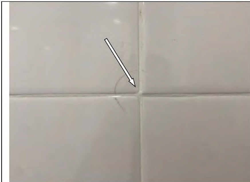
Фото №22. Неровные швы настенной керамической плитки в ванной комнате.
