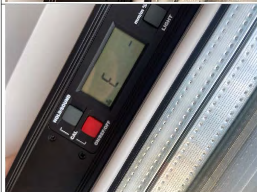
Фото №78. Отклонения от вертикали оконного блока ПВХ в спальне.
