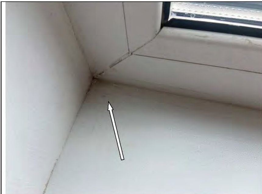
Фото №55. Дефект на лицевой стороне подоконной доски оконного блока ПВХ в спальне.
