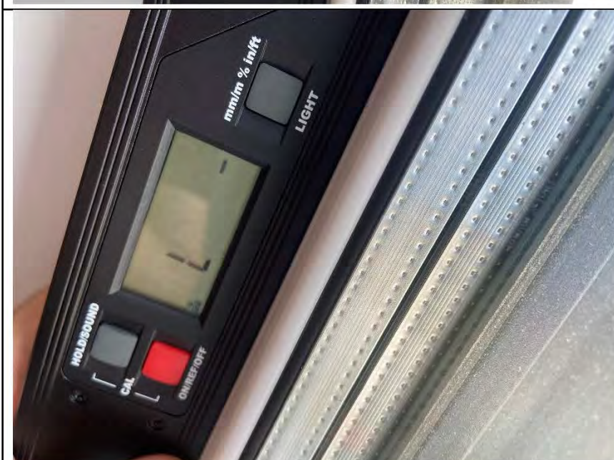
Фото №80. Отклонения от вертикали оконного блока ПВХ в кухне.
