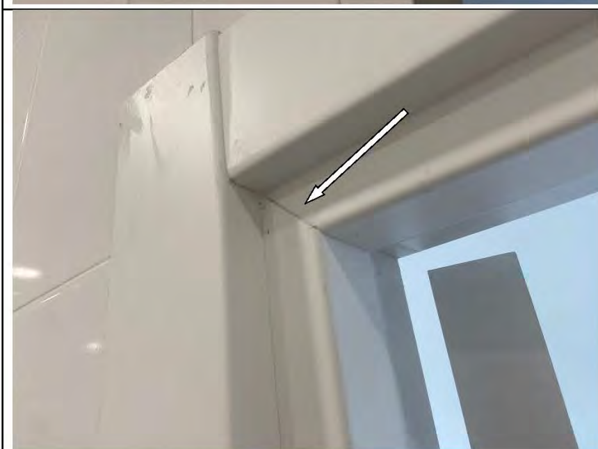
Фото №99. Дефект на коробке деревянного дверного блока в ванной комнате.
