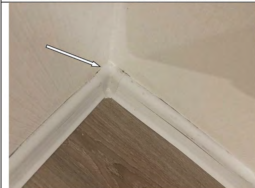
Фото №41. Дефект на напольном плинтусе ПВХ в кухне.
