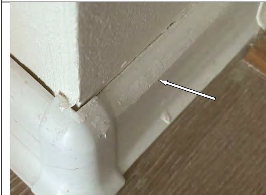
Фото №36. Дефект на напольном плинтусе ПВХ в коридоре.
