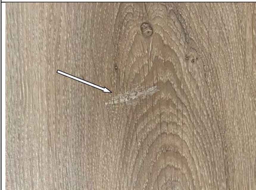
Фото №50. Дефект на напольном покрытии из ламината в гардеробной.
