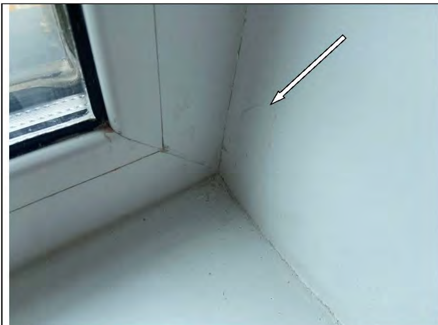
Фото №73. Неровности, выбоины, раковины на окрашенных откосах оконного блока ПВХ в спальне.
