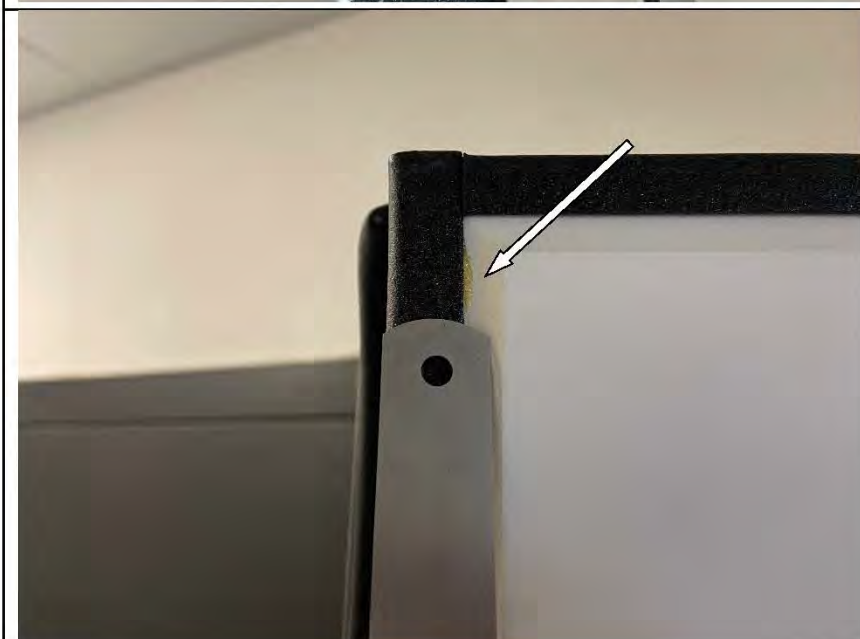
Фото №87. Дефект на полотне входного дверного блока в коридоре.
