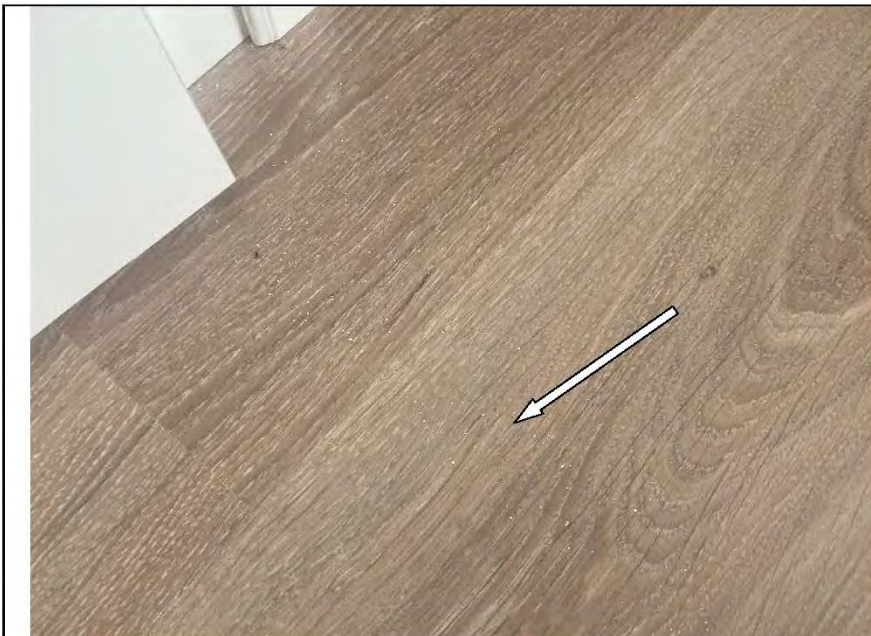
Фото №46. Дефект на напольном покрытии из ламината в спальне.
