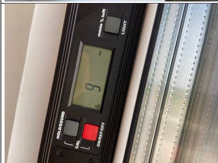
Фото №77. Отклонения от вертикали оконного блока ПВХ в детской.
