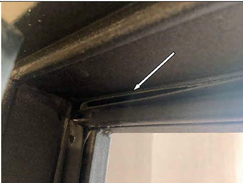
Фото №104. Дефект на уплотнительной противопожарной ленте входного дверного блока в коридоре.
