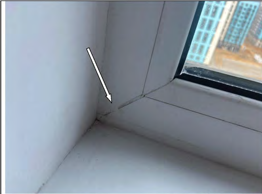
Фото №61. Дефект на профиле оконного блока ПВХ в спальне.
