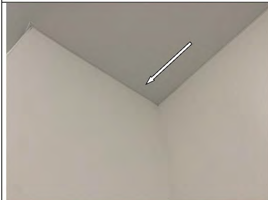
Фото №113. Дефект на поверхности натяжного потолка в санузле.
