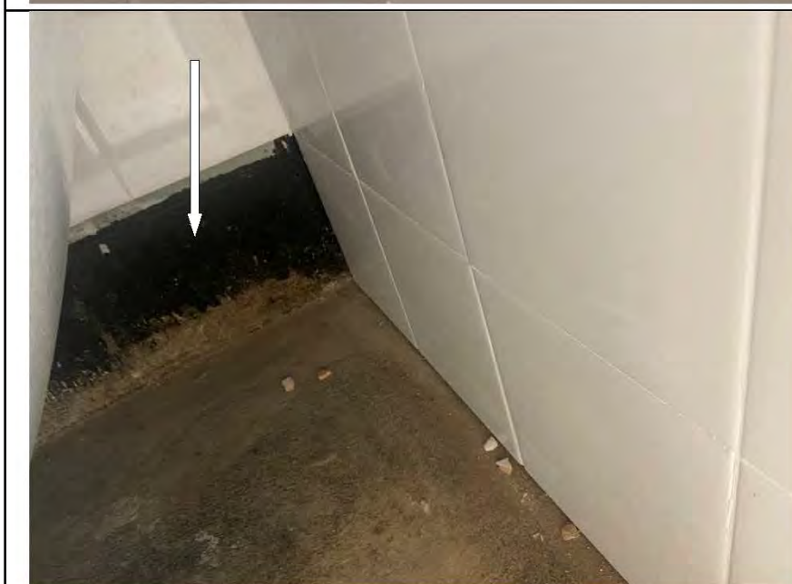
Фото №24. Частично отсутствует настенная керамическая плитка в ванной комнате.
