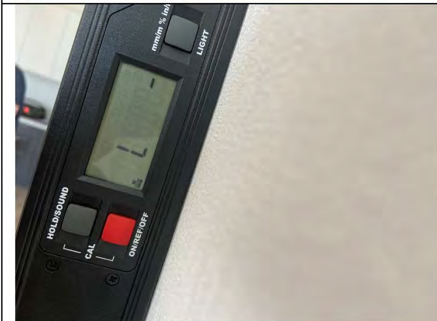
Фото №14. Отклонения поверхности стен от вертикали в кухне.
