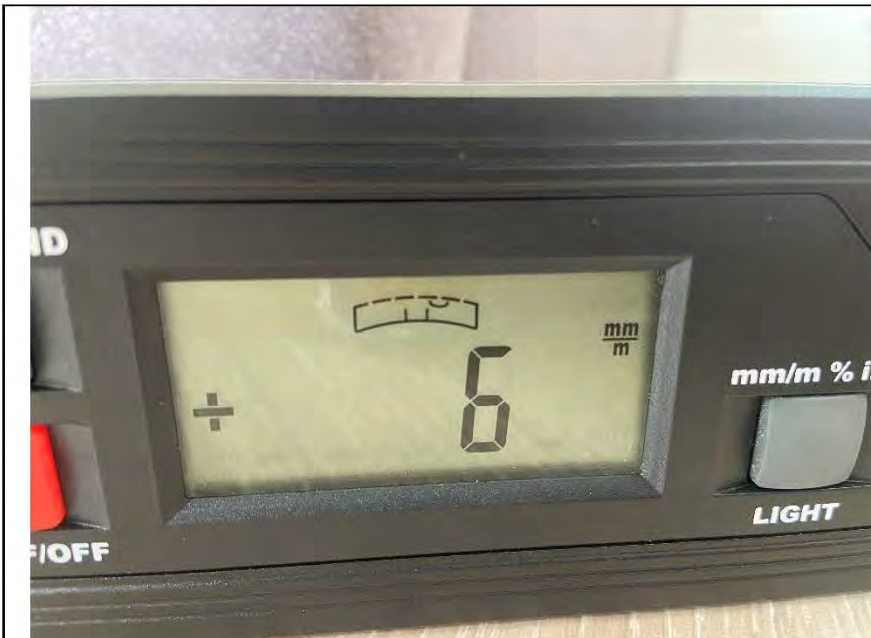
Фото №28. Отклонения поверхности напольного покрытия из ламината в спальне.
