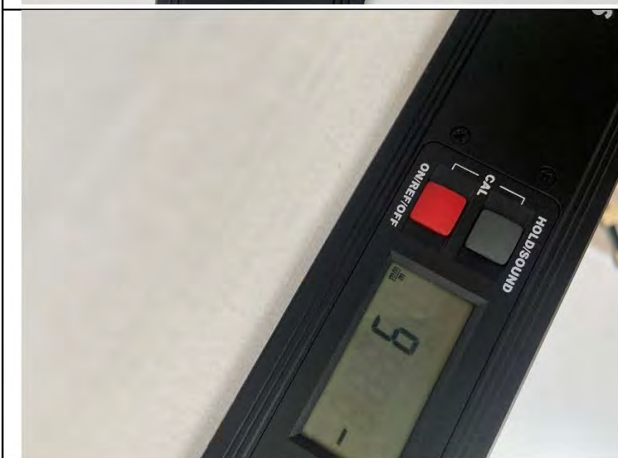
Фото №12. Отклонения поверхности стен от вертикали в спальне.
