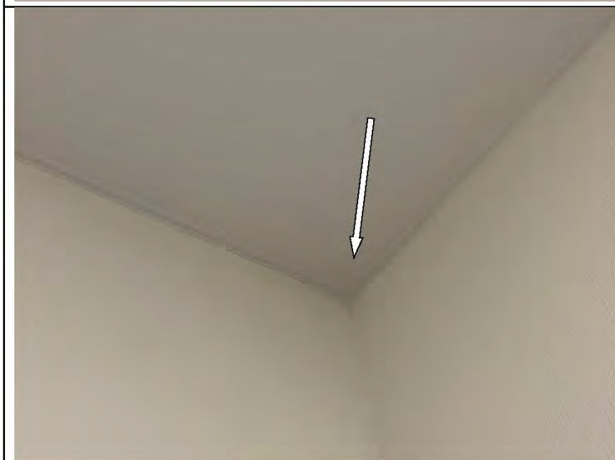
Фото №114. Дефект на поверхности натяжного потолка в гардеробной.
