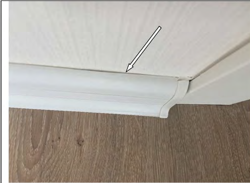
Фото №40. Дефект на напольном плинтусе ПВХ в кабинете.
