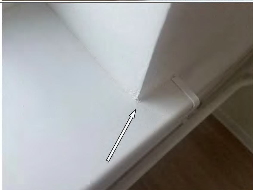
Фото №54. Дефект на лицевой стороне подоконной доски оконного блока ПВХ в спальне.
