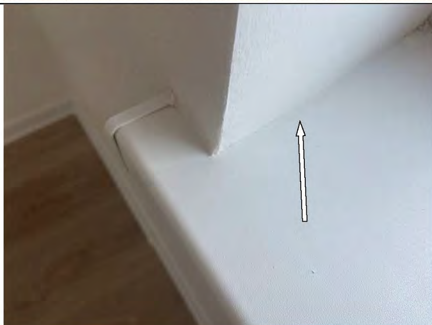
Фото №53. Дефект на лицевой стороне подоконной доски оконного блока ПВХ в детской.
