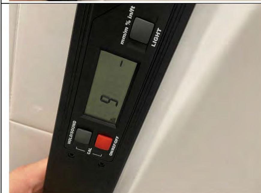
Фото №17. Отклонения поверхности стен от вертикали в санузле.
