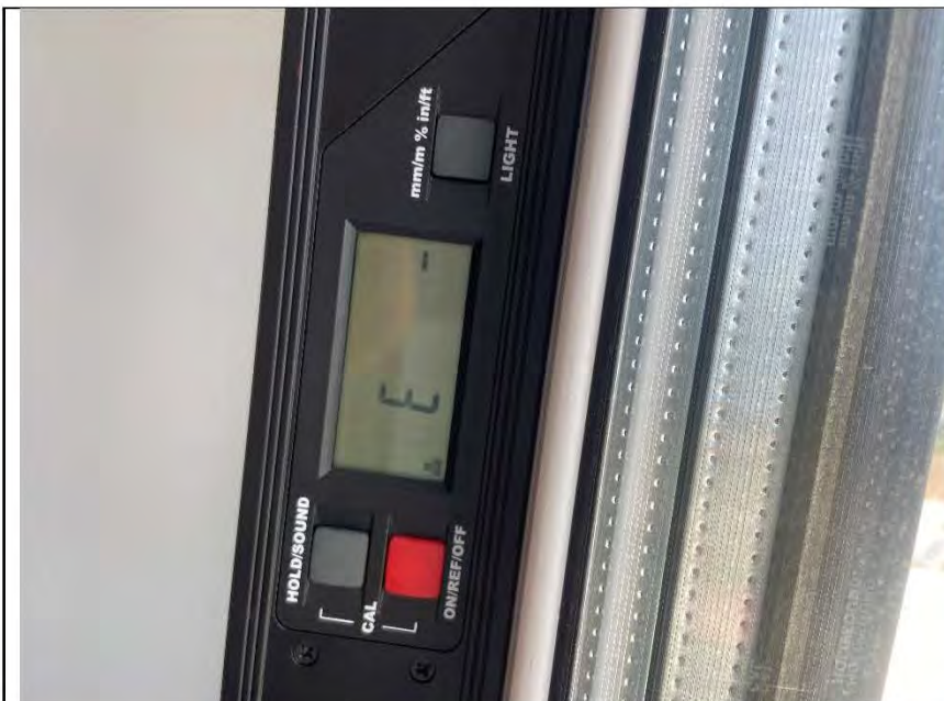
Фото №79. Отклонения от вертикали оконного блока ПВХ в кухне.
