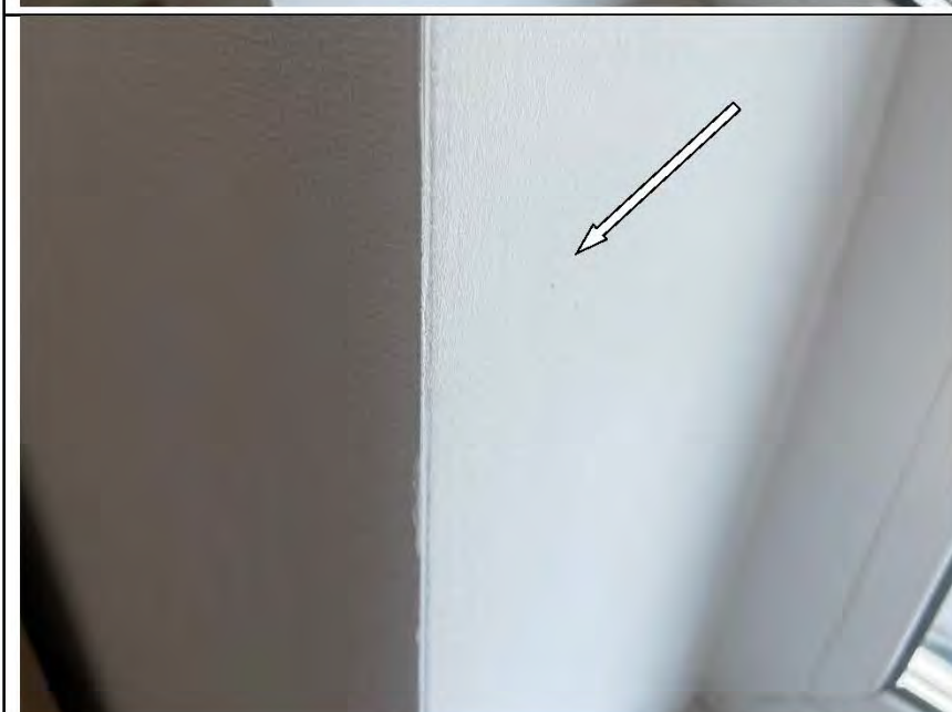
Фото №72. Неровности, выбоины, раковины на окрашенных откосах оконного блока ПВХ в спальне.
