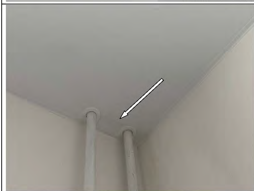
Фото №111. Дефект на поверхности натяжного потолка в спальне.
