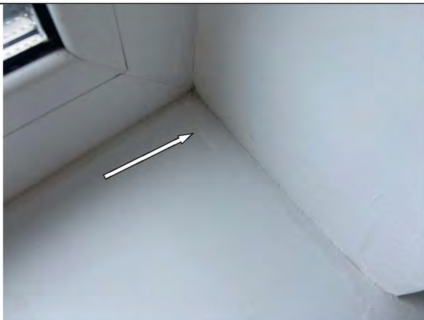
Фото №56. Дефект на лицевой стороне подоконной доски оконного блока ПВХ в кабинете.
