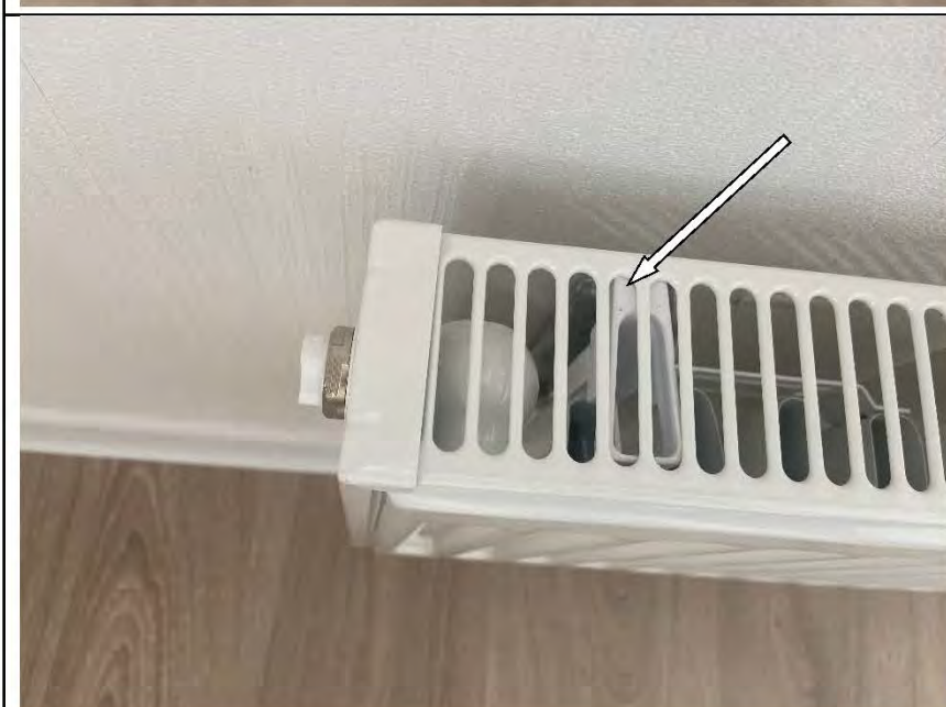
Фото №117. Дефект на металлическом кожухе отопительного прибора в спальне.
