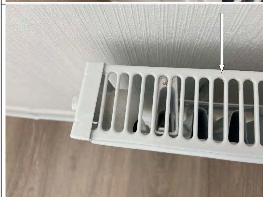
Фото №119. Дефект на металлическом кожухе отопительного прибора в кабинете.
