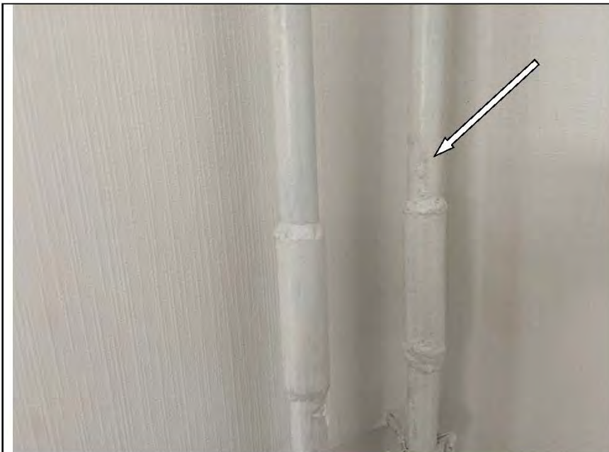
Фото №82. Неровности, подтеки на окрашенных трубах отопления в спальне.
