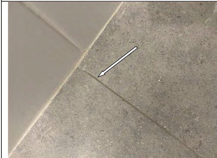
Фото №35. Неровные швы напольной керамической плитки в санузле.
