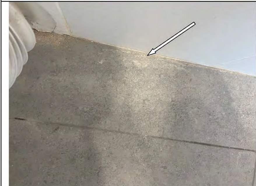
Фото №32. Загрязнения на напольной керамической плитке в ванной комнате.
