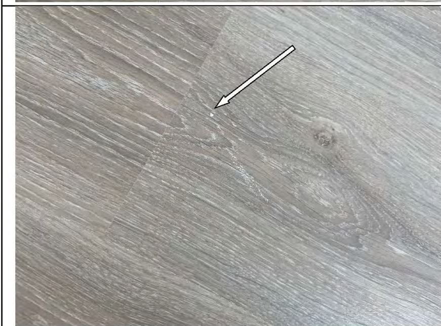
Фото №45. Дефект на напольном покрытии из ламината в детской.
