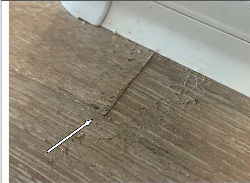
Фото №43. Дефект на напольном покрытии из ламината в коридоре.
