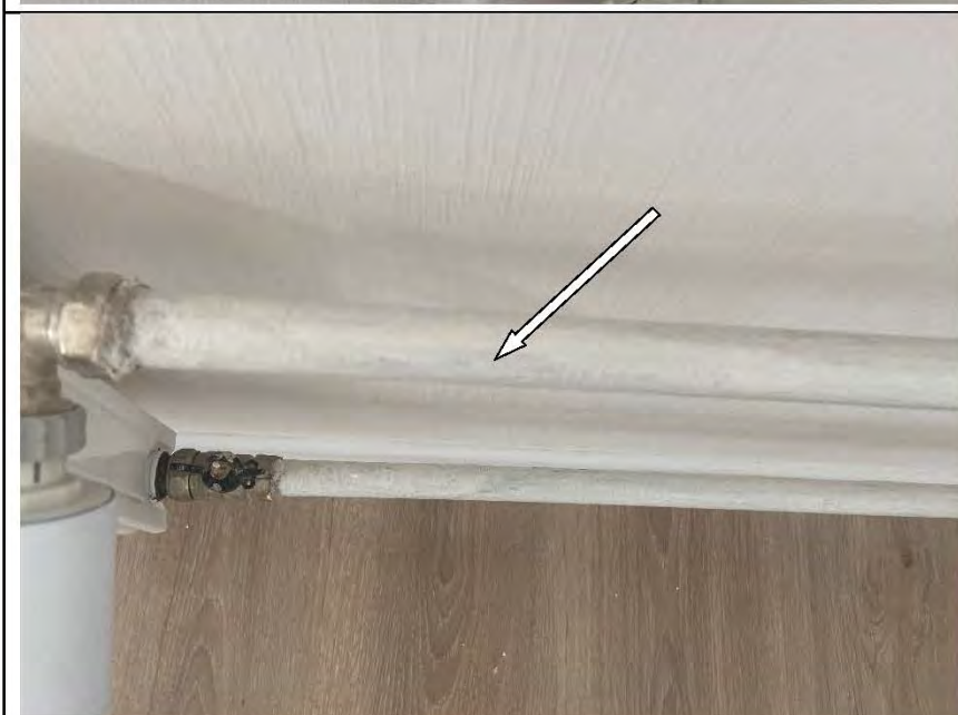
Фото №83. Неровности, подтеки на окрашенных трубах отопления в спальне.
