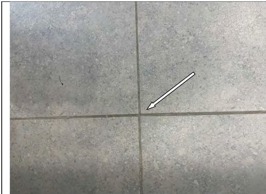
Фото №34. Неровные швы напольной керамической плитки в ванной комнате.
