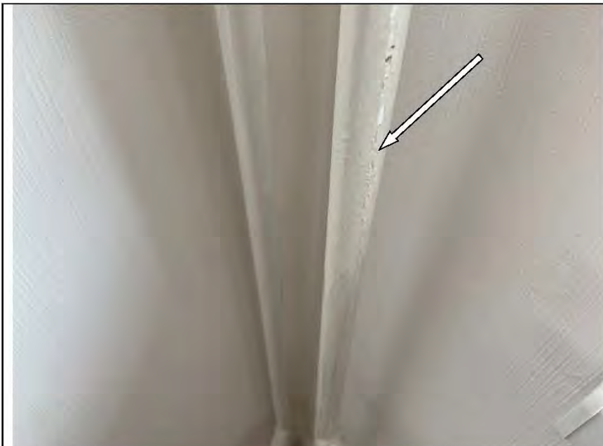
Фото №85. Неровности, подтеки на окрашенных трубах отопления в кухне.
