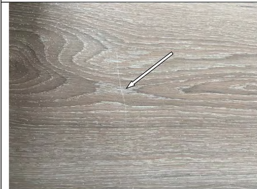
Фото №44. Дефект на напольном покрытии из ламината в коридоре.
