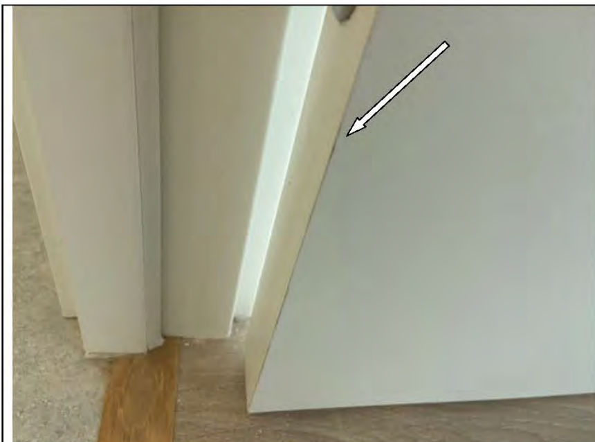
Фото №88. Дефект на полотне деревянного дверного блока в ванной комнате.
