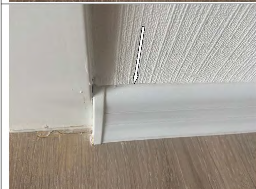
Фото №39. Дефект на напольном плинтусе ПВХ в спальне.
