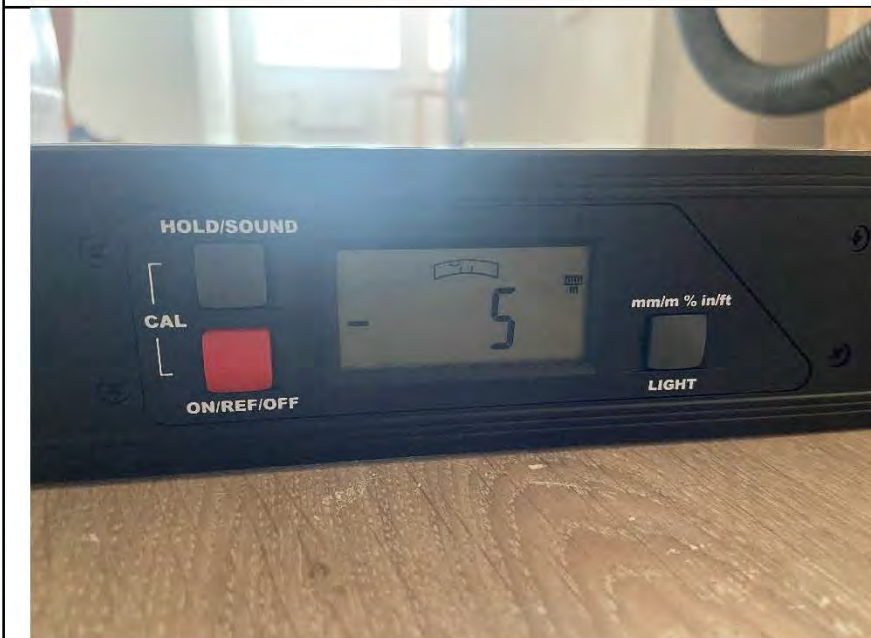
Фото №26. Отклонения поверхности напольного покрытия из ламината в коридоре.
