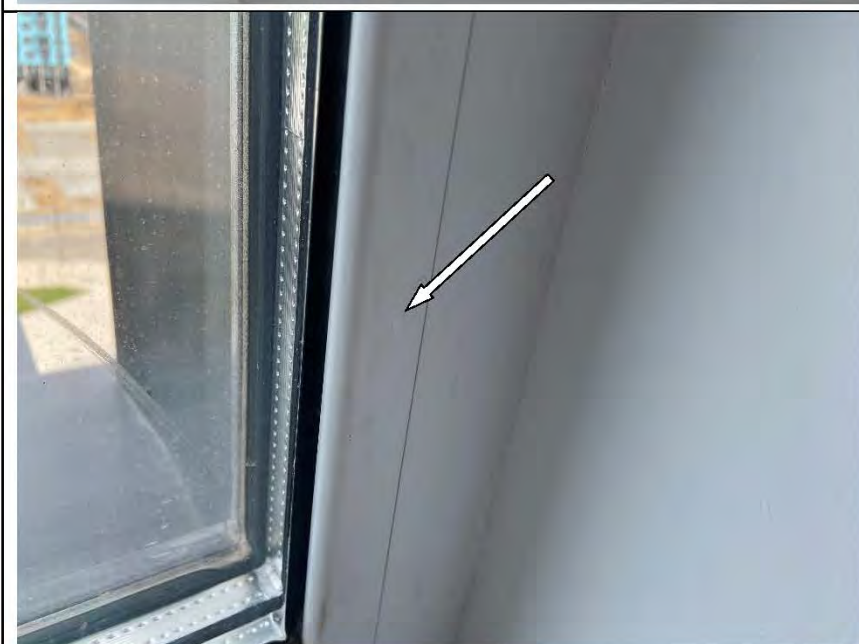
Фото №63. Дефект на профиле оконного блока ПВХ в кухне.
