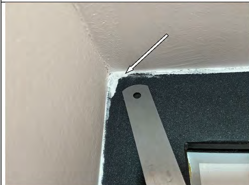
Фото №86. Дефект на коробке входного дверного блока в коридоре.
