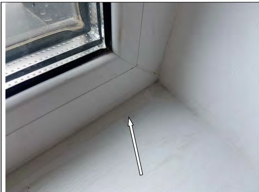
Фото №58. Дефект на лицевой стороне подоконной доски оконного блока ПВХ в кухне.
