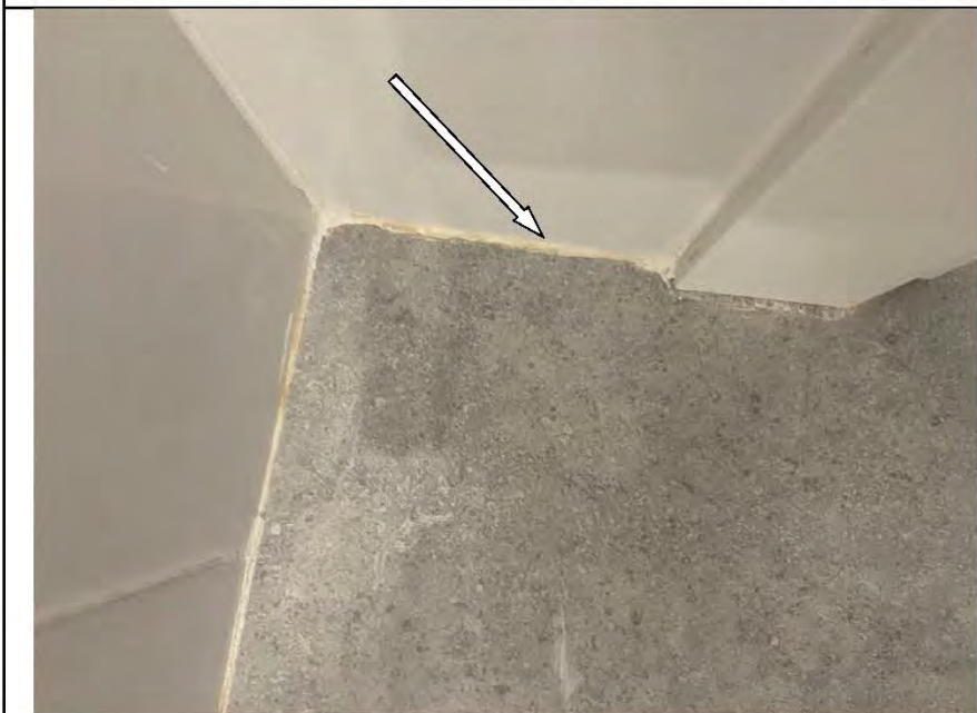
Фото №33. Загрязнения на напольной керамической плитке в санузле.
