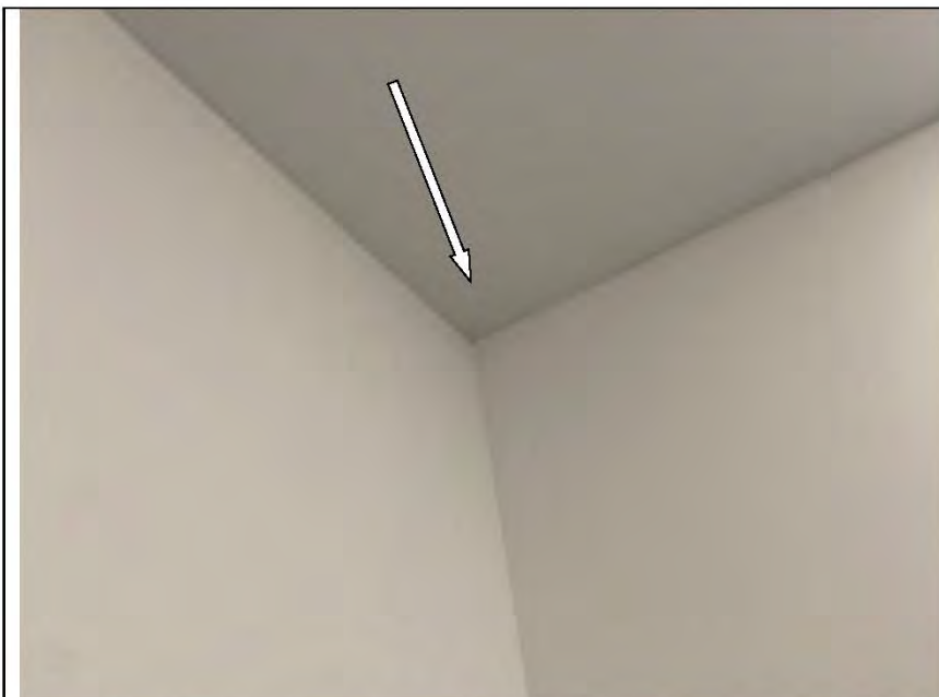
Фото №115. Дефект на поверхности натяжного потолка в кабинете.
