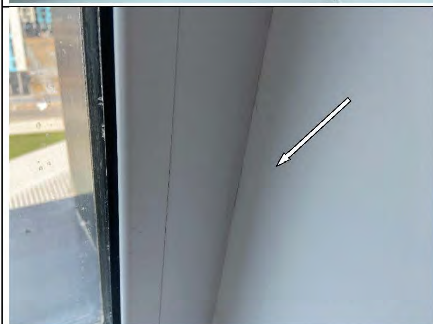
Фото №74. Неровности, выбоины, раковины на окрашенных откосах оконного блока ПВХ в кабинете.
