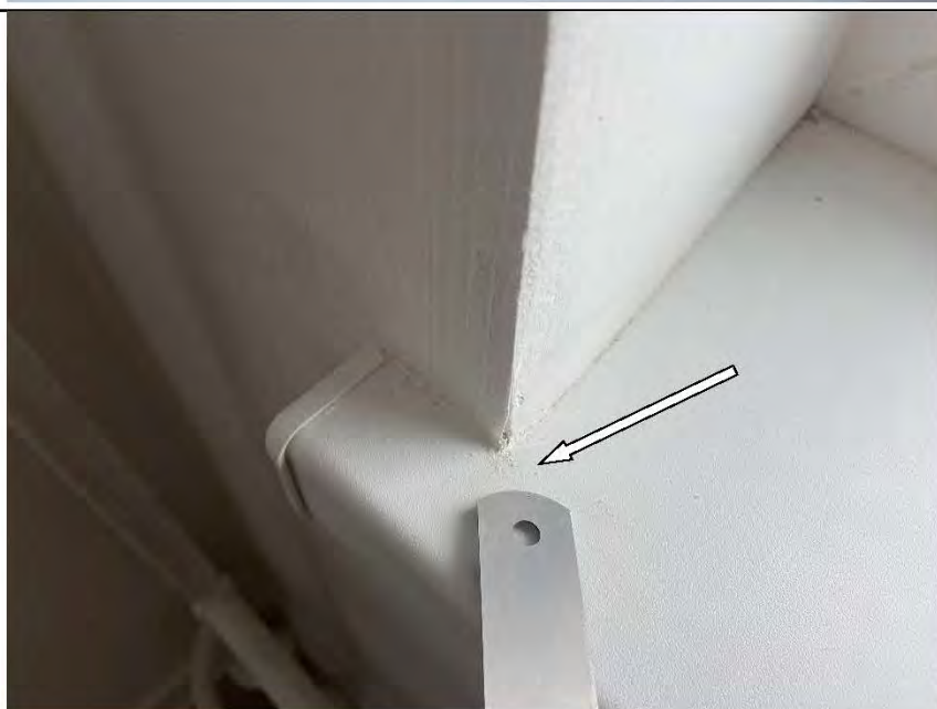
Фото №57. Дефект на лицевой стороне подоконной доски оконного блока ПВХ в кухне.
