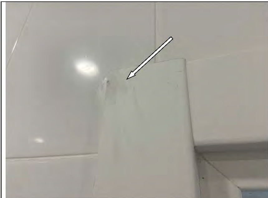
Фото №94. Дефект на наличниках деревянного дверного блока в ванной комнате.
