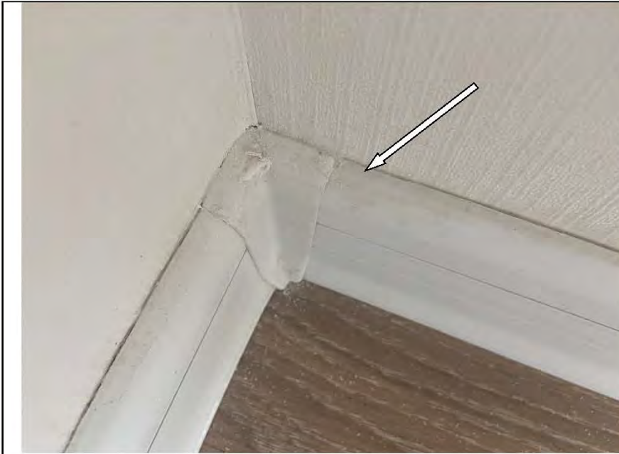
Фото №37. Дефект на напольном плинтусе ПВХ в коридоре.
