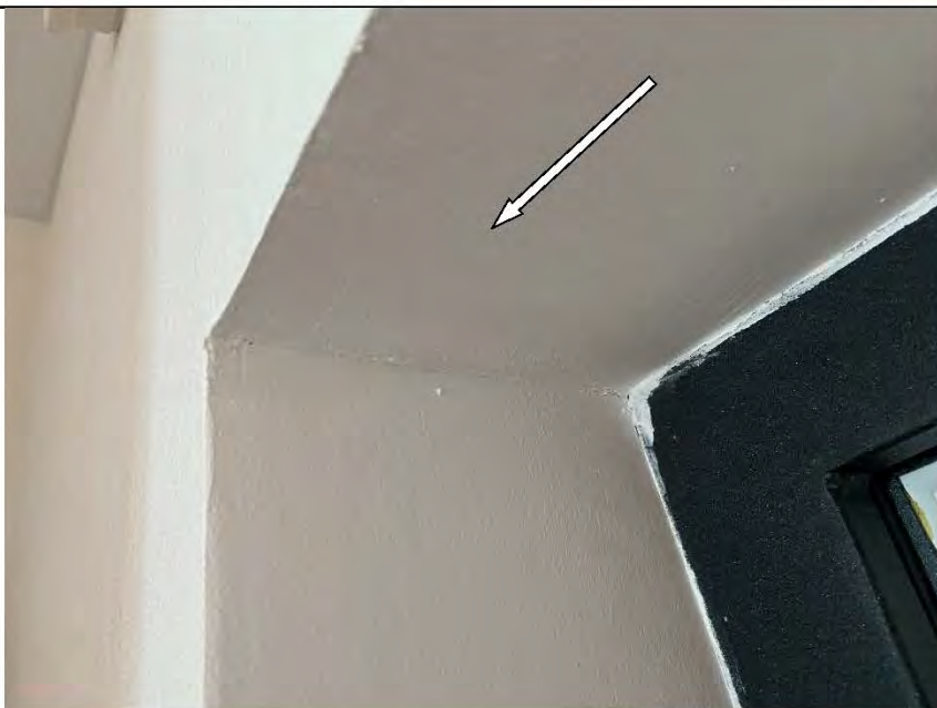
Фото №105. Неровности, выбоины, раковины на окрашенных откосах входного дверного блока в коридоре.
