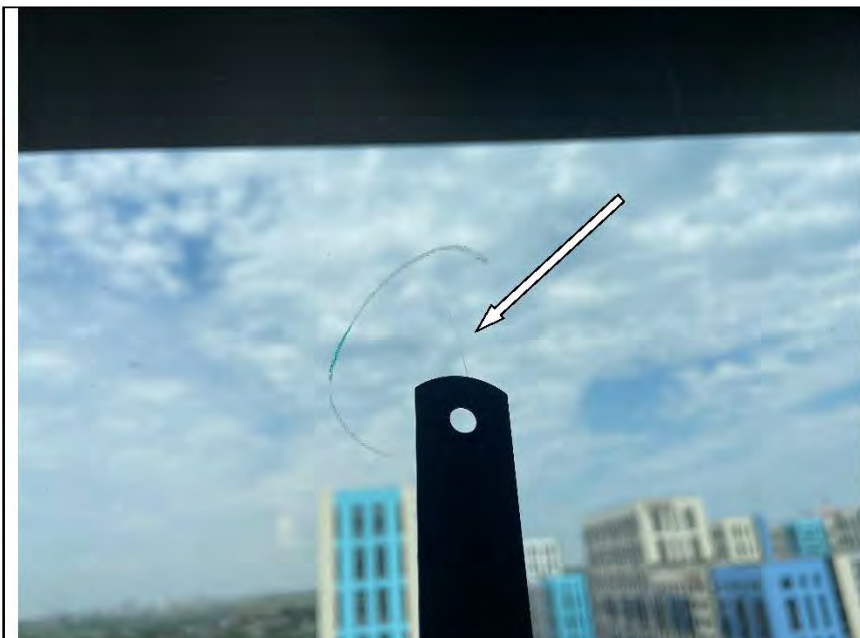
Фото №70. Царапина на стеклопакете оконного блока ПВХ в кухне.
