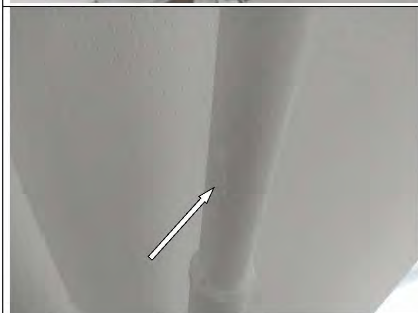
Фото №81. Окрашивание труб отопления выполнено с дефектами в кабинете (подтеки).
