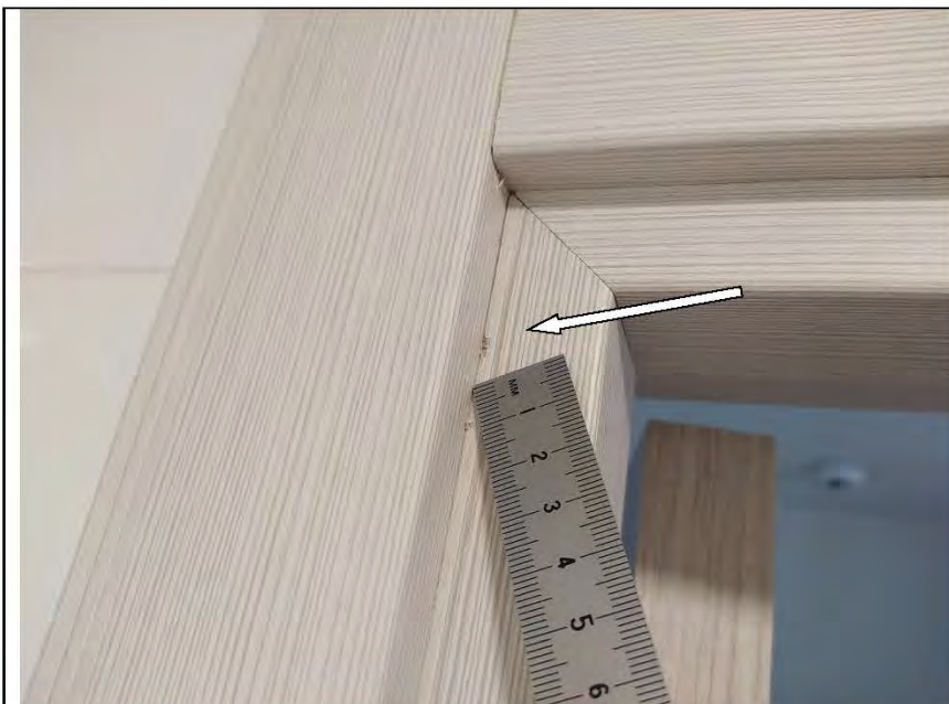
Фото №52. Коробка деревянного дверного блока в санузле имеет дефекты (скол).
