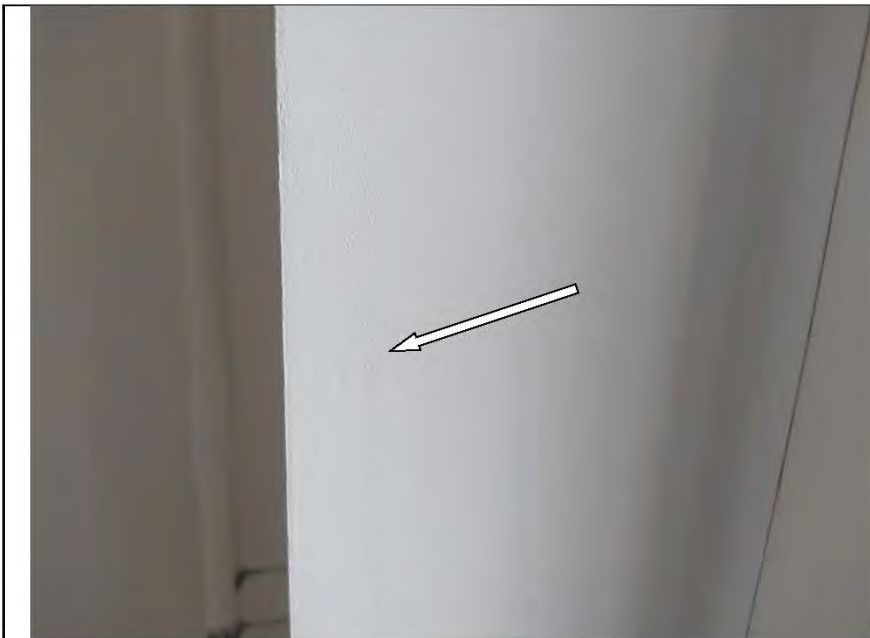
Фото №31. Окрашенные откосы дверного блока в кабинете выполнены с дефектами (раковины)
