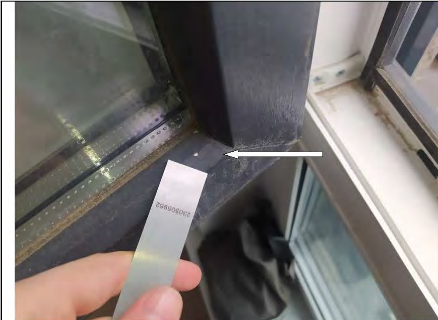
Фото №34. Профиль ПВХ оконного блока в кухне имеет дефекты (скол).
