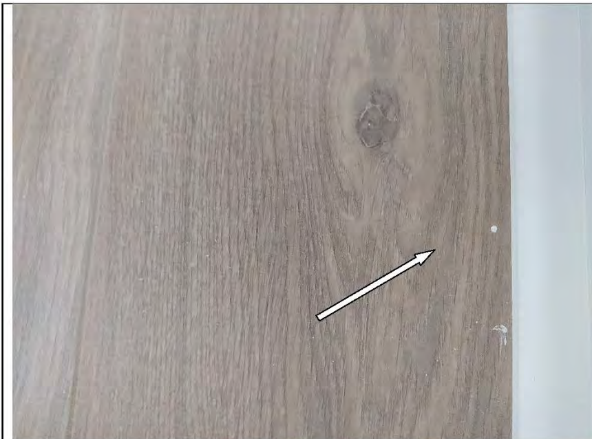
Фото №61. Загрязнения на поверхности ламината в спальне
