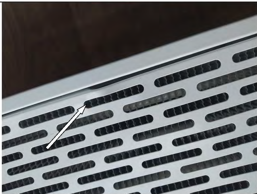
Фото №66. Отопительный прибор имеет дефект покраски защитного кожуха в кабинете (замятие)
