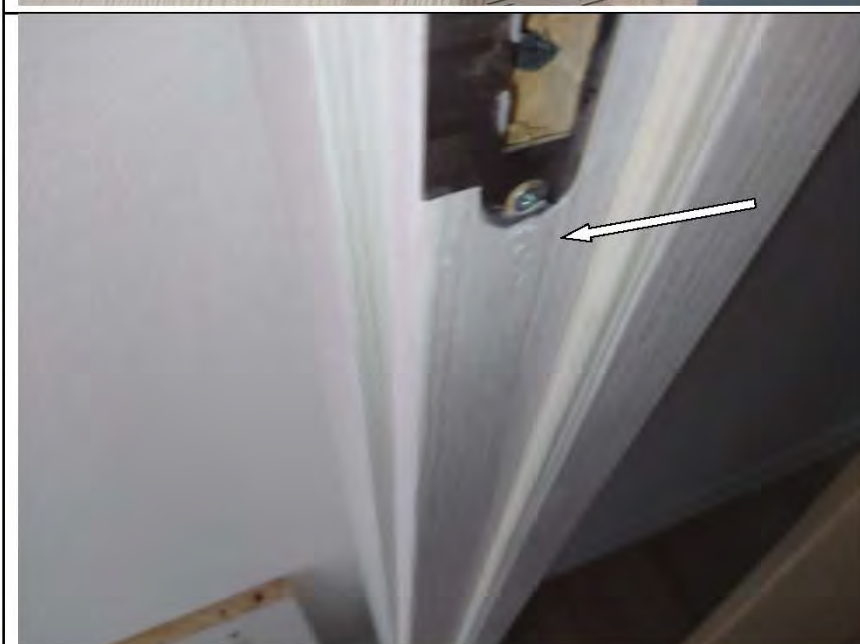
Фото №53. Коробка деревянного дверного блока в гостиной имеет дефекты (загрязнение малярными составами).
