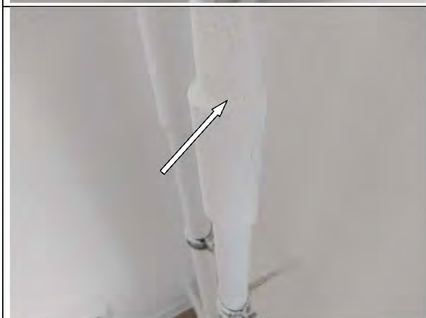
Фото №80. Окрашивание труб отопления выполнено с дефектами в спальне (подтеки).
