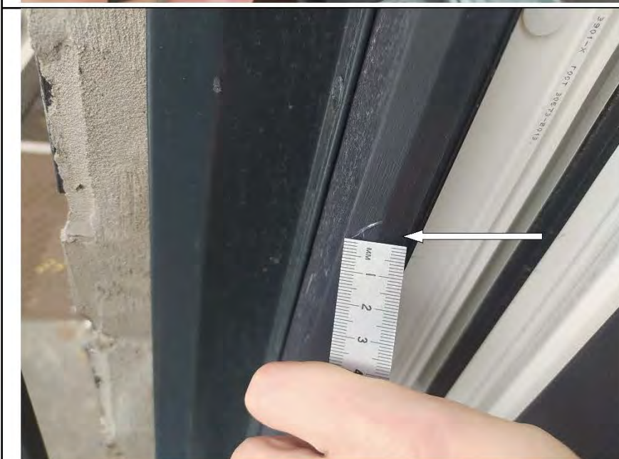
Фото №35. Профиль ПВХ дверного блока в кухне имеет дефекты (царапина).
