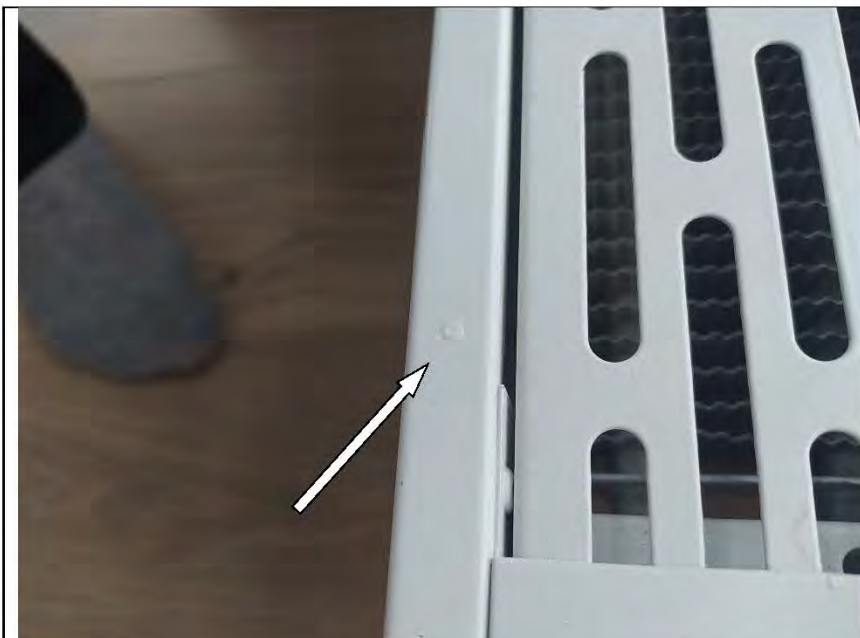
Фото №67. Отопительный прибор №3 имеет дефект покраски защитного кожуха в гостиной (загрязнение малярными составами)
