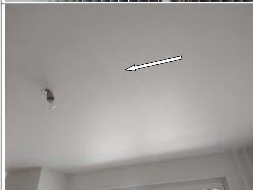
Фото №71. Загрязнение полотна натяжного потолка в кухне
