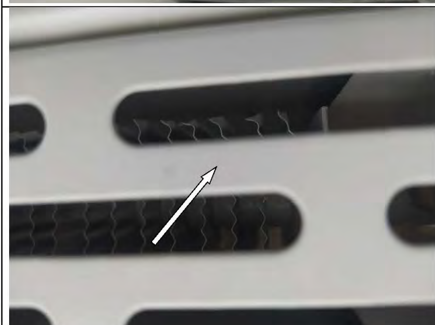
Фото №69. Радиатор №2 в кухне имеет дефекты (замятия).
