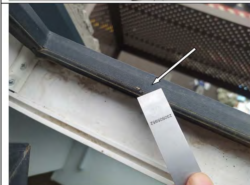
Фото №38. Профиль ПВХ оконного блока в спальне имеет дефекты (скол).
