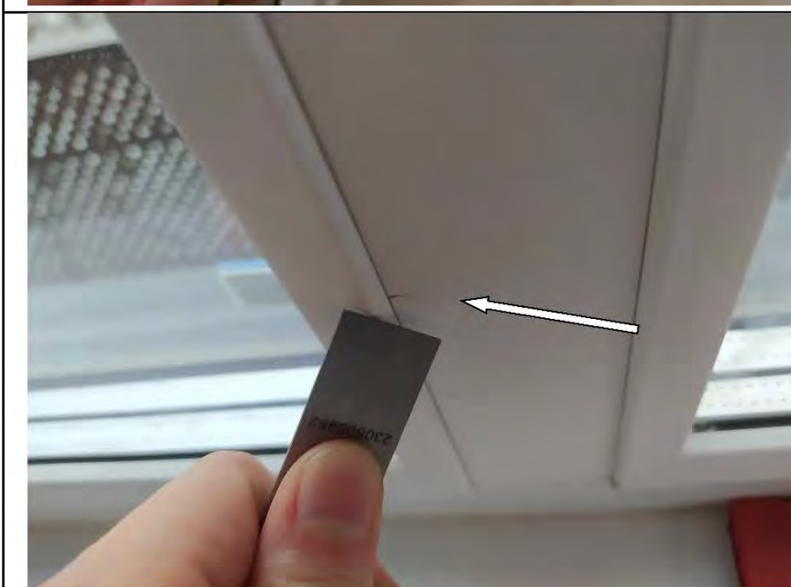
Фото №45. Профиль ПВХ оконного блока в гостиной имеет дефекты (царапина).
