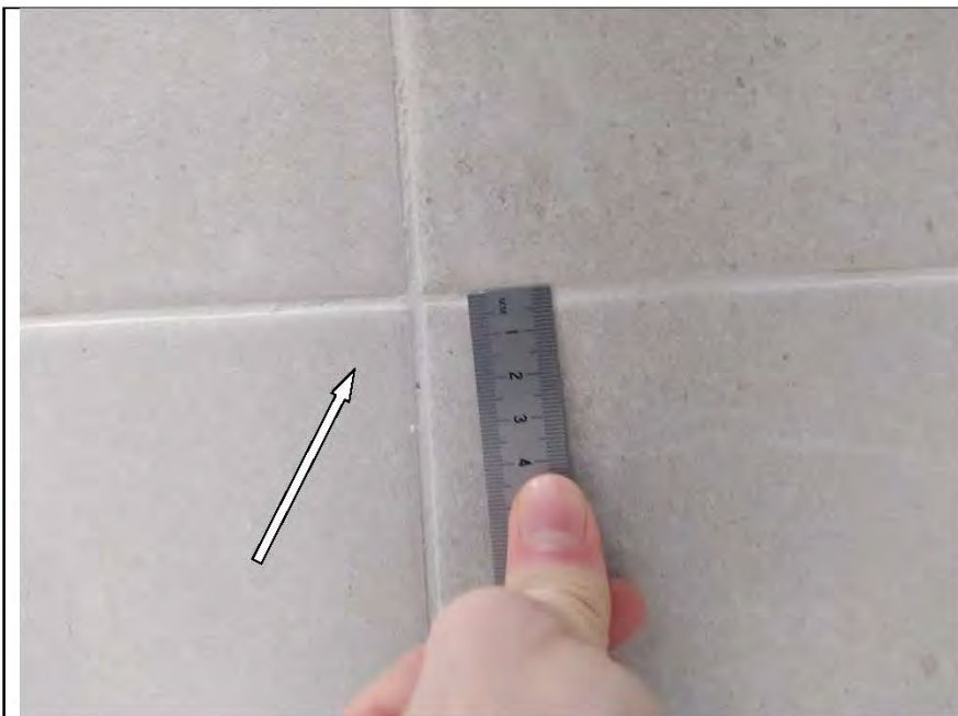
Фото №58. Затирка напольной плитки в кухне выполнена с нарушениями (разность ширины шва)
