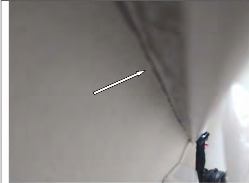
Фото №49. Отверстие под подоконником в кухне не загерметизировано
