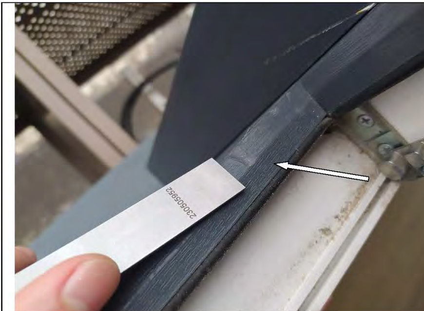
Фото №43. Профиль ПВХ оконного блока в гостиной имеет дефекты (скол).
