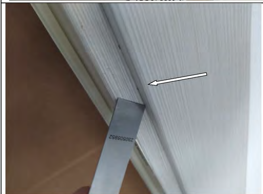
Фото №51. Коробка деревянного дверного блока в спальне имеет дефекты (скол).
