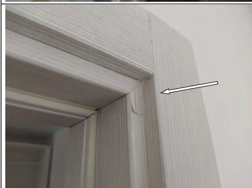
Фото №54. Коробка деревянного дверного блока в кабинете имеет дефекты (скол).
