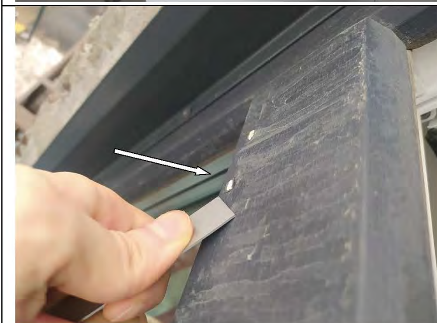
Фото №32. Профиль ПВХ оконного блока в кухне имеет дефекты (скол).
