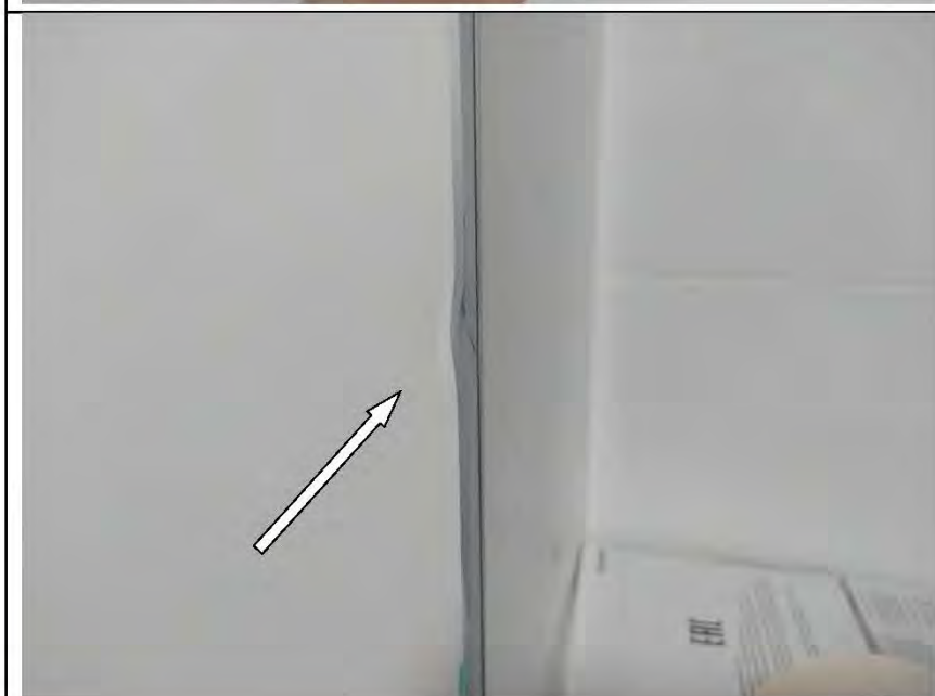
Фото №77. Дефект стеновой панели ПВХ в ванной комнате
