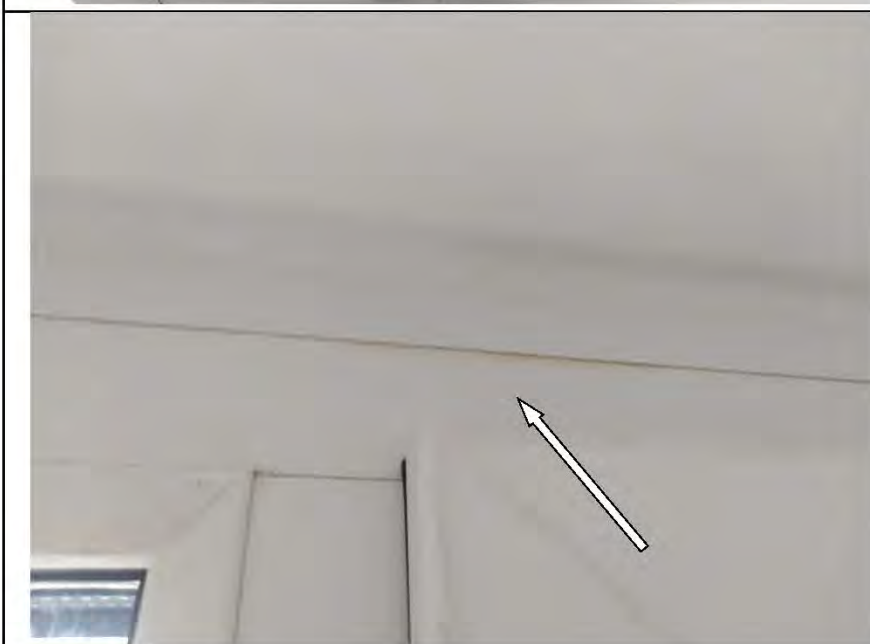
Фото №48. Профиль ПВХ дверного блока в кабинете имеет дефекты (загрязнение строительными составами).
