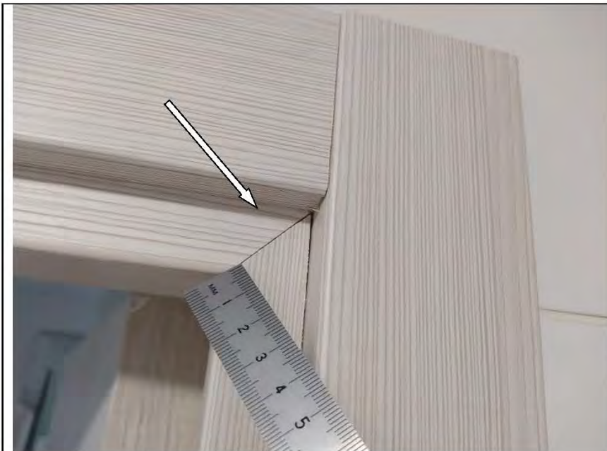
Фото №55. Элементы дверного блока соединены (коробка) не надежно в ванной комнате
