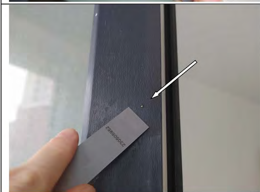
Фото №39. Профиль ПВХ оконного блока в спальне имеет дефекты (скол).
