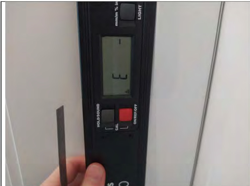
Фото №64. Отклонение коробки входного дверного блока
