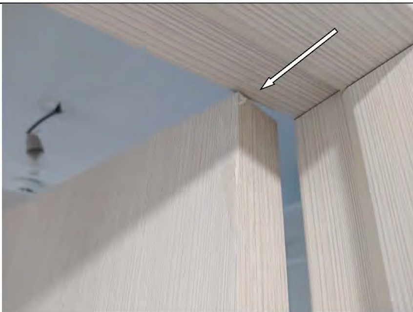
Фото №57. Дефекты (скол) на лицевой поверхности полотна деревянного дверного блока в ванной комнате
