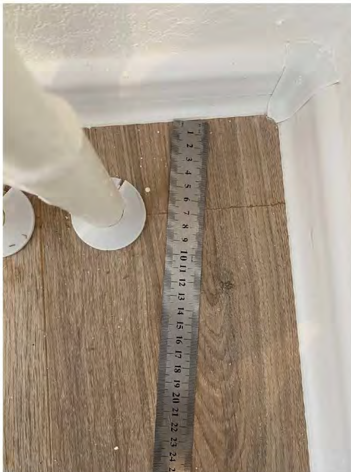
Фото 58. Комната 1 (10,6 кв.м.) 4.7 Сколы на напольном покрытии из ламинированной доски
