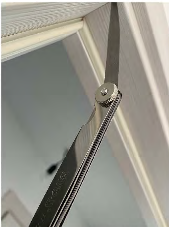
Фото 59. Комната 1 (10,6 кв.м.) 4.8 На дверном блоке имеется зазор 0,4 мм между смежными элементами
