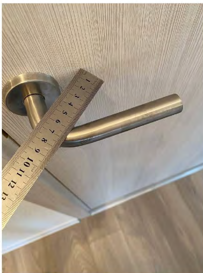
Фото 31. Санузел (3,5 кв.м.) 2.6 Царапины, следы коррозии на фурнитуре
