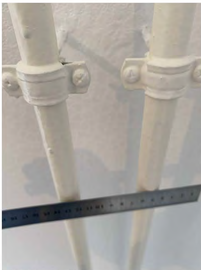
Фото 50. Комната 1 (10,6 кв.м.) 4.2 Некачественная окраска труб отопления: разводы
