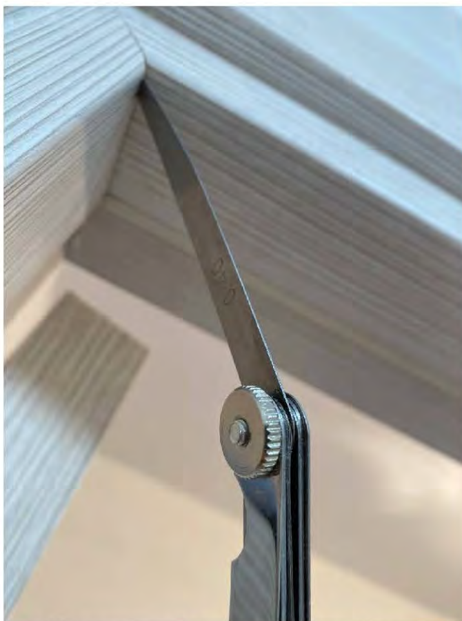
Фото 24. Санузел (3,5 кв.м.) 2.2 На дверном блоке имеется зазор 0,4 мм между смежными элементами
