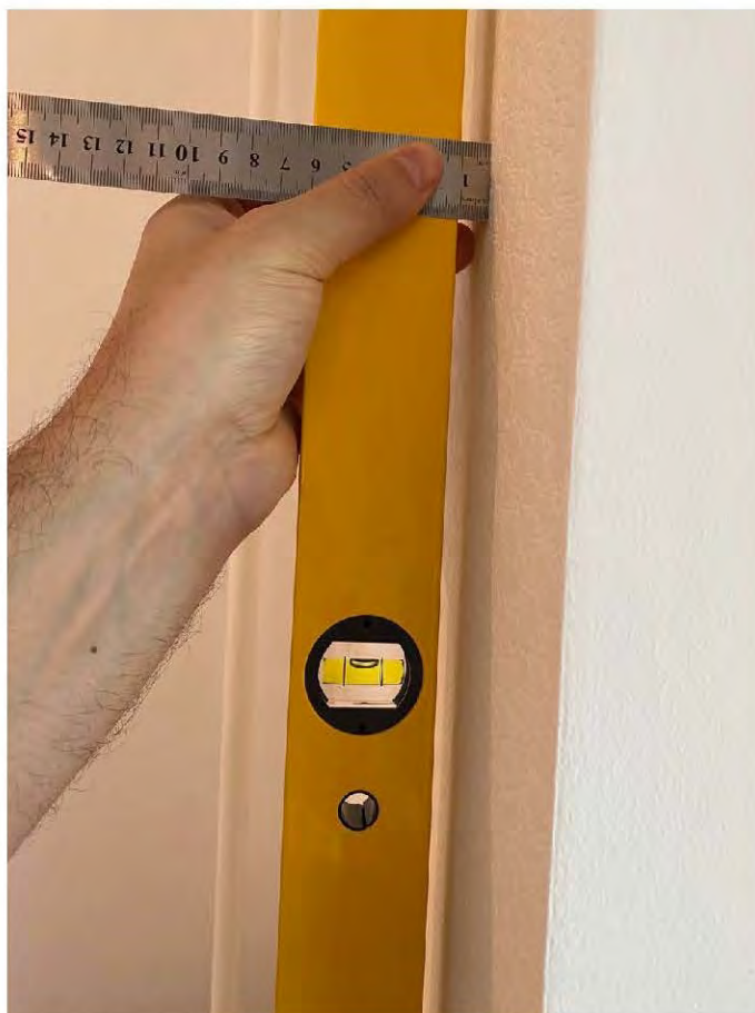
Фото 45-47. Кухня (16,3 кв.м.) 3.8 Отклонения участков стен от вертикали 10 мм, 8 мм
