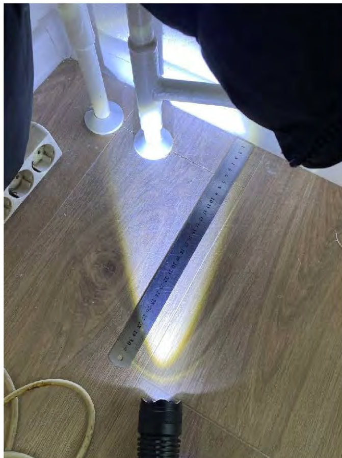
Фото 42. Кухня (16,3 кв.м.) 3.6 Сколы на напольном покрытии из ламинированной доски
