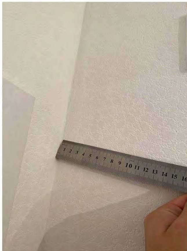
Фото 13-15. Коридор (6,5 кв.м.) 1.3 Локальные участки имеют: замятины, пятна, загрязнения, отслоения обоев
