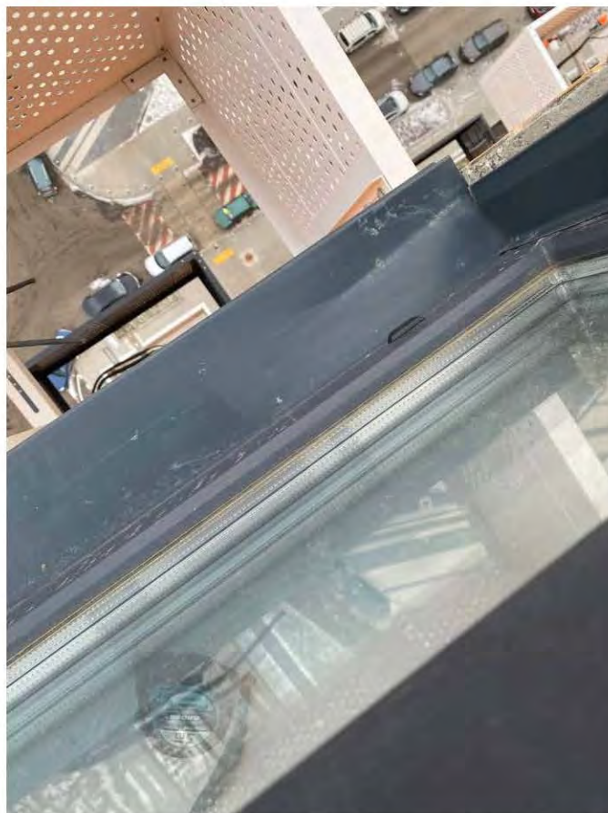
Фото 53. Комната 1 (10,6 кв.м.) 4.4 Повреждение на отливе
