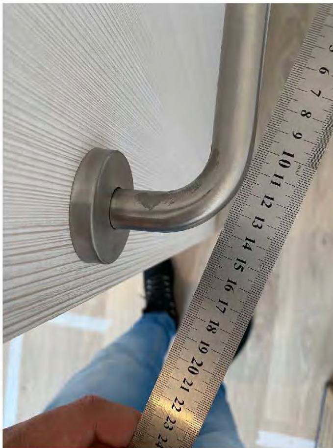
Фото 60. Комната 1 (10,6 кв.м.) 4.9 Царапины, следы коррозии на фурнитуре
