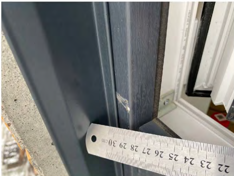
Фото 38-40. Кухня (16,3 кв.м.) 3.4 Множественные повреждения на оконных блоках царапины, сколы, потертости
