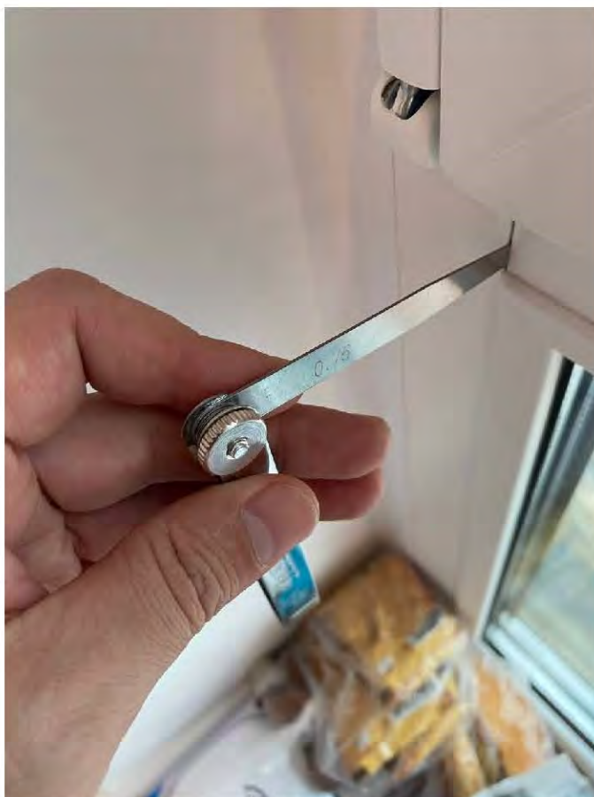
Фото 41. Кухня (16,3 кв.м.) 3.5 Зазор 0,75 мм между элементами оконного блока
