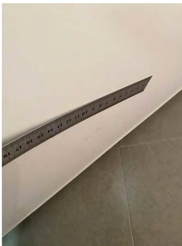
Фото 9-11. Коридор (6,5 кв.м.) 1.1 На входной двери имеются царапины, сколы
