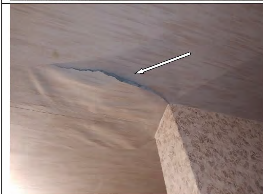
Фото №20. Потолки, оклеенные обоями, в прихожей имеют дефекты характерные последствиям залива (отслоения).
