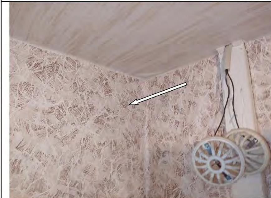
Фото №17. Стены, оклеенные обоями, в прихожей имеют дефекты характерные последствиям залива (вздутия).
