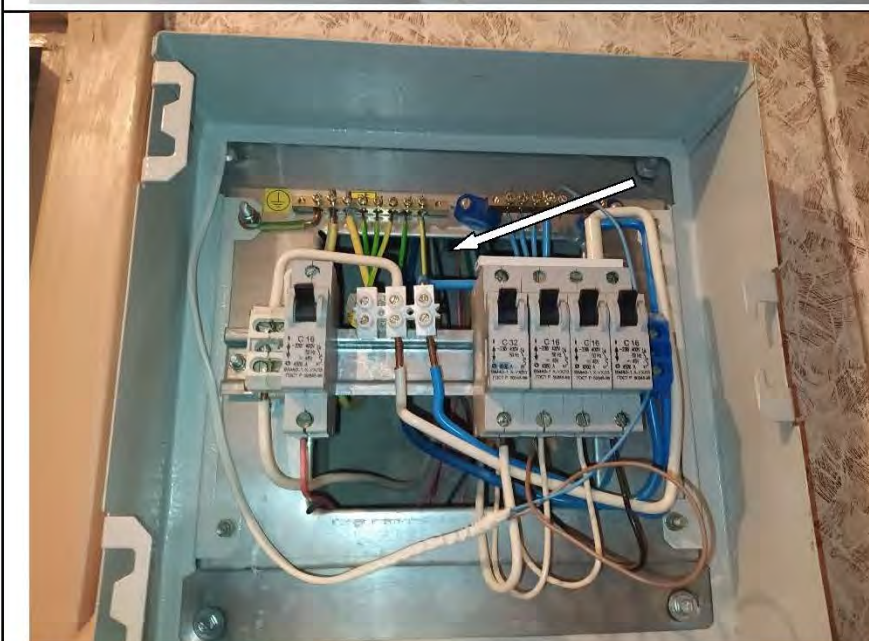
Фото №24. Отсутствие УЗО в электрическом щитке.
