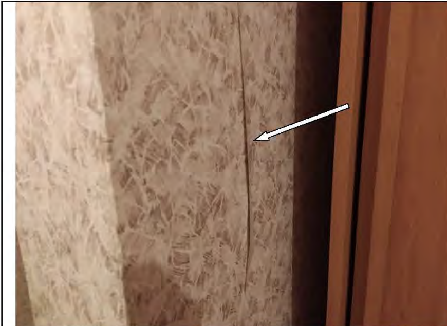
Фото №16. Стены, оклеенные обоями, в прихожей имеют дефекты характерные последствиям залива (отслоения).
