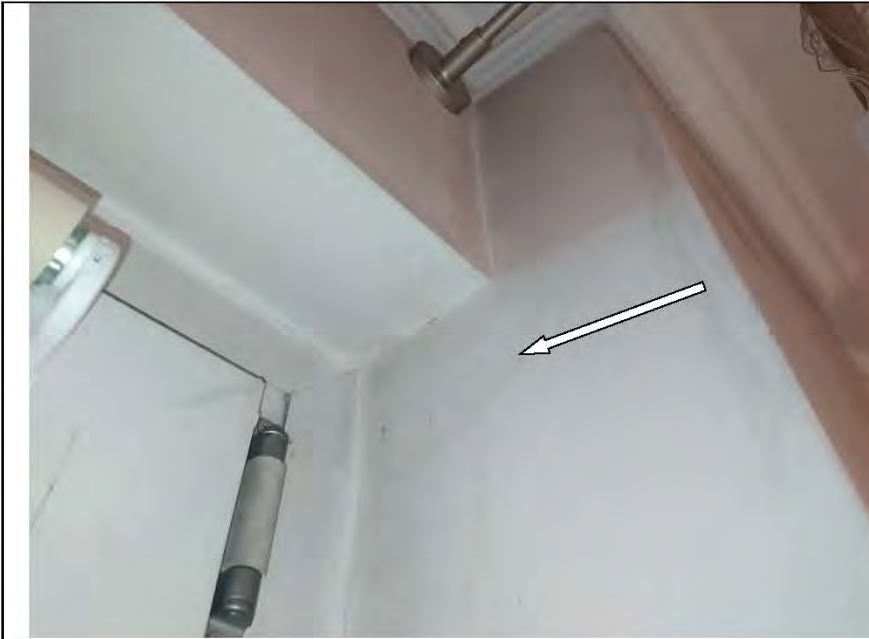
Фото №22. Окрашенные откосы оконного блока ПВХ в кухне имеют дефекты характерные последствиям залива (пожелтение).
