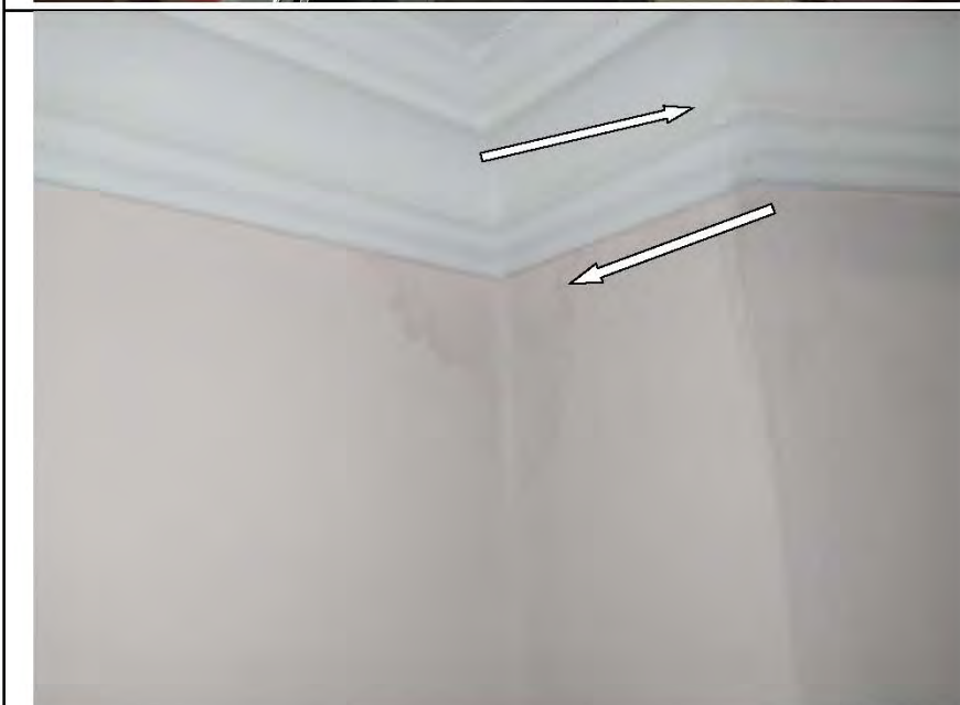
Фото №9. Стены, оклеенные обоями, в кухне имеют дефекты характерные последствиям залива (пожелтение). Потолочные ПВХ плинтуса в кухне имеют дефекты характерные последствиям залива (пожелтение).
