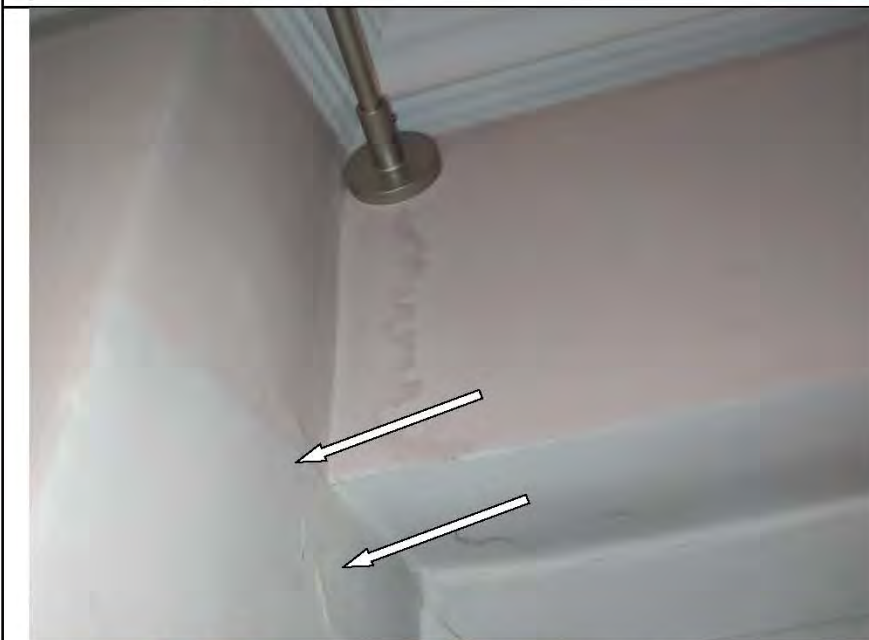
Фото №23. Окрашенные откосы оконного блока ПВХ в кухне имеют дефекты характерные последствиям залива (пожелтение, отлупы).
