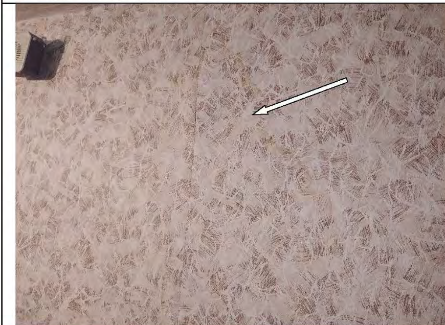
Фото №18. Стены, оклеенные обоями, в прихожей имеют дефекты характерные последствиям залива (пожелтение).
