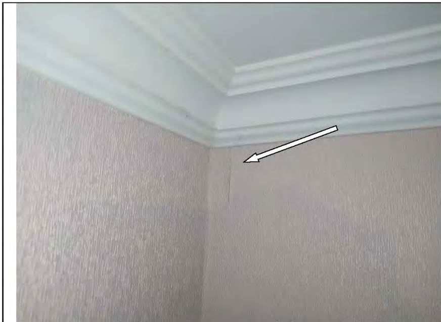
Фото №19. Стены, оклеенные обоями, в спальне имеют дефекты характерные последствиям залива (отслоения).
