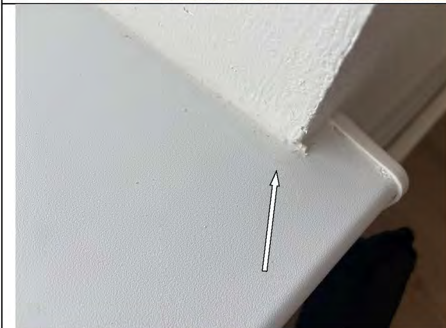
Фото №23. Дефекты на лицевой стороне подоконной доски оконного блока ПВХ в общей комнате.
