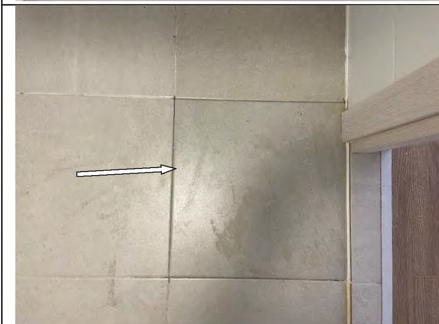
Фото №12. Разный цвет напольной керамической плитки в ванной комнате.
