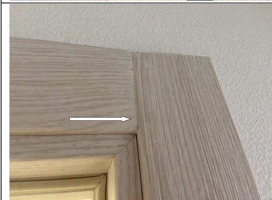
Фото №36. Дефект на наличниках деревянного дверного блока в ванной комнате.
