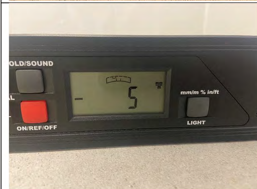
Фото №15. Отклонения поверхности напольного покрытия из керамической плитки в ванной комнате.
