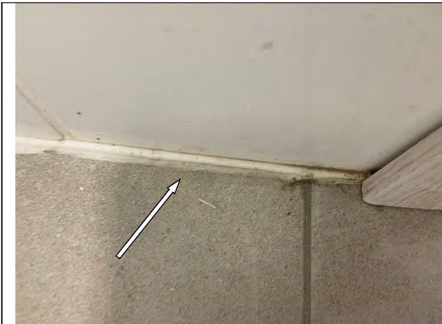
Фото №16. Загрязнения на напольной керамической плитке в ванной комнате.
