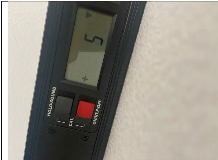
Фото №7. Отклонения поверхности стен от вертикали в общей комнате.
