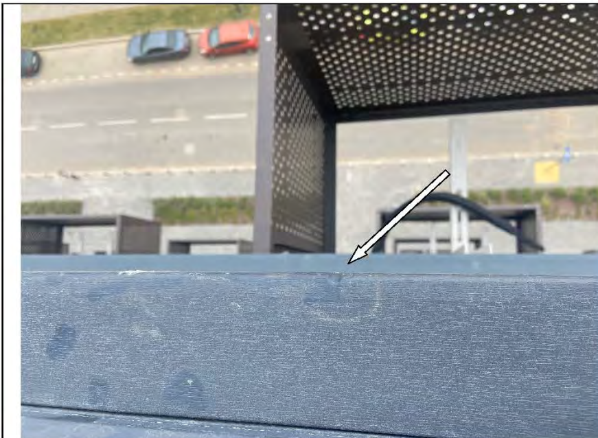
Фото №25. Скол на профиле оконного блока ПВХ в общей комнате.
