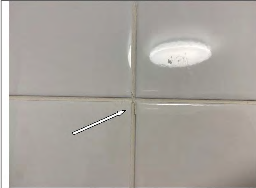
Фото №10. Неровные швы настенной керамической плитки в ванной комнате.
