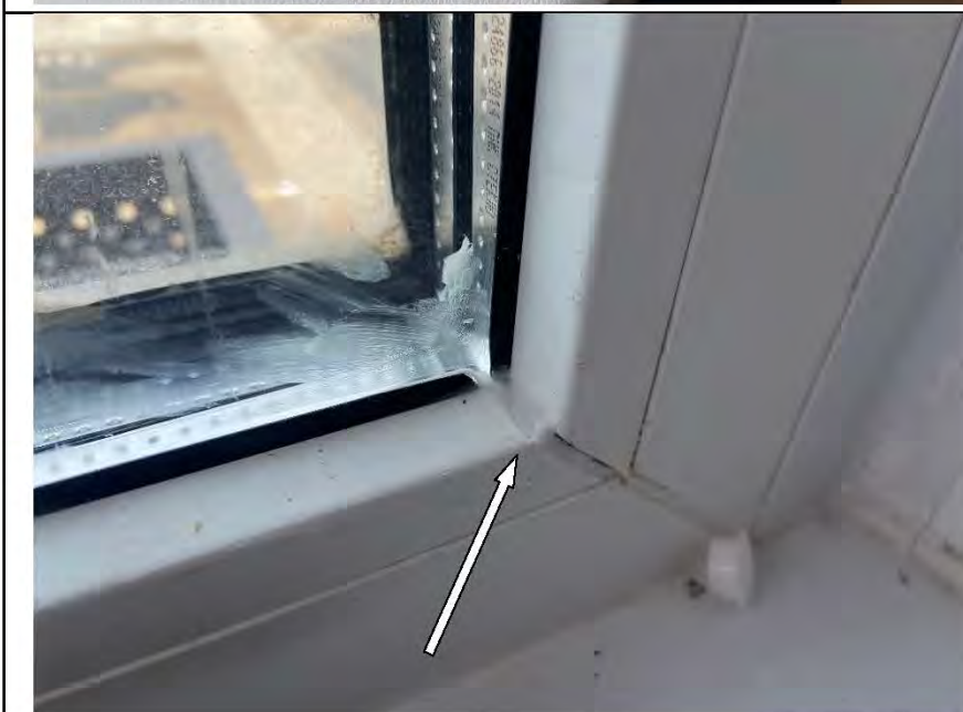
Фото №24. Дефект на профиле оконного блока ПВХ в общей комнате.
