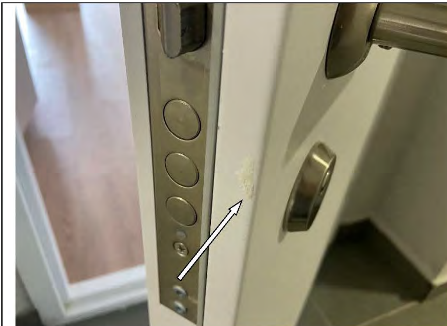
Фото №34. Дефект на полотне входного дверного блока в коридоре.
