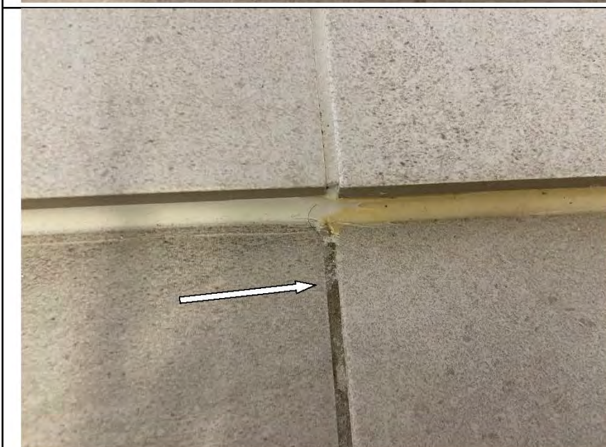
Фото №17. Неровные швы напольной керамической плитки в ванной комнате.
