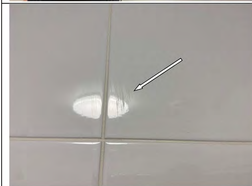
Фото №9. Загрязнения на настенной керамической плитке в ванной комнате.
