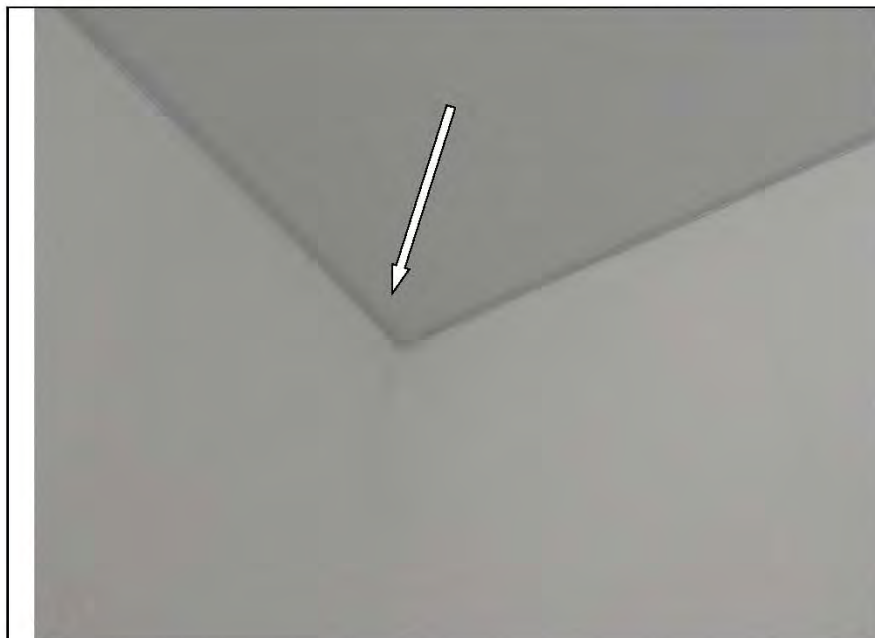
Фото №40. Дефект на поверхности натяжного потолка в коридоре.
