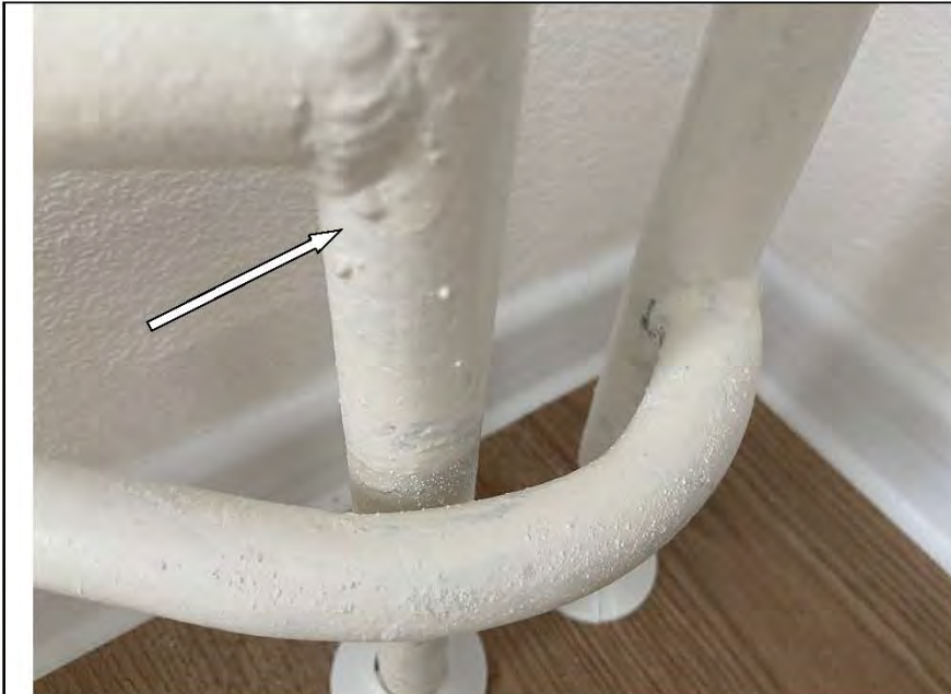
Фото №31. Неровности, подтеки на окрашенных трубах отопления в общей комнате.
