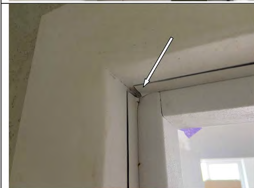
Фото №39. Дефект на уплотнительной противопожарной ленте входного дверного блока в коридоре.
