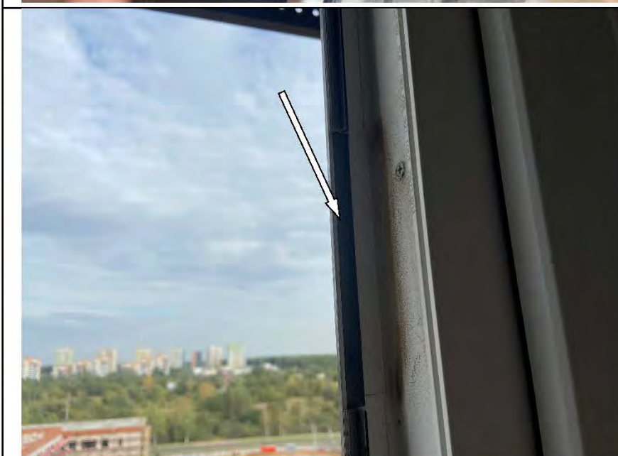
Фото №29. Дефект на уплотнительной ленте оконного блока ПВХ в общей комнате.
