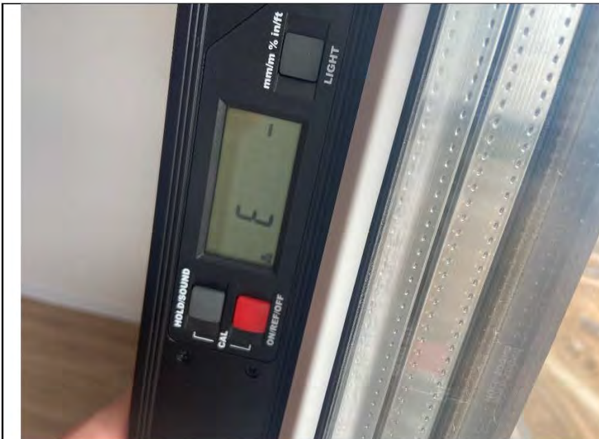
Фото №28. Отклонения от вертикали оконного блока ПВХ в общей комнате.
