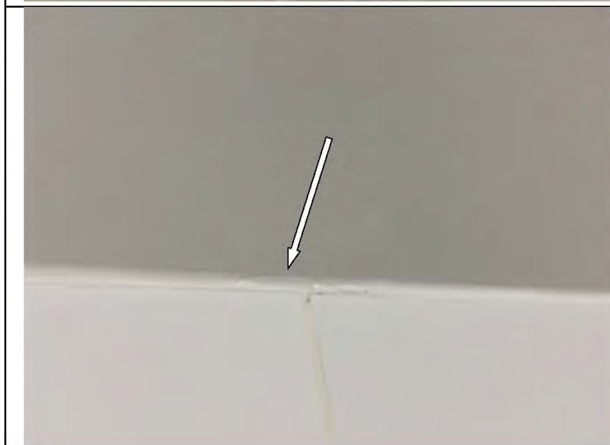
Фото №42. Дефект на поверхности подвесного потолка в ванной комнате.
