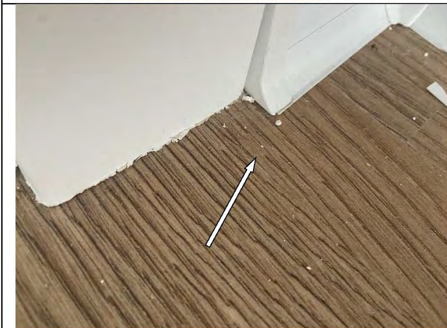
Фото №20. Дефект на напольном покрытии из ламината в коридоре.
