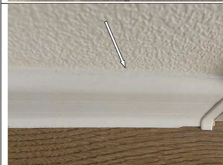
Фото №18. Дефект на напольном плинтусе ПВХ в коридоре.
