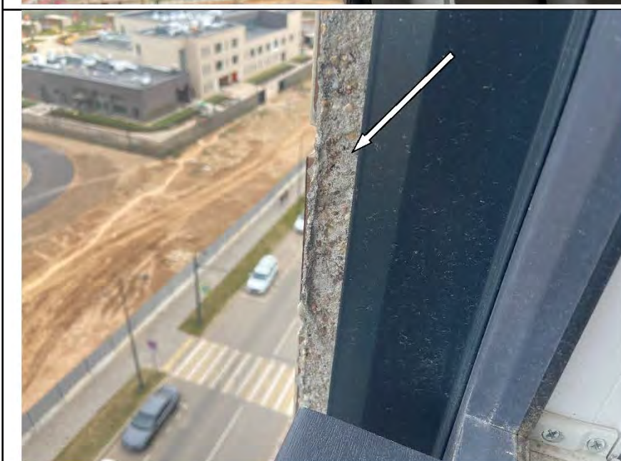
Фото №30. Частично отсутствует металлический отлив оконного блока ПВХ в общей комнате.
