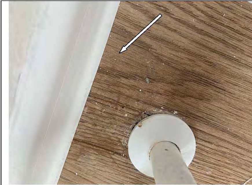
Фото №22. Дефект на напольном покрытии из ламината в общей комнате.
