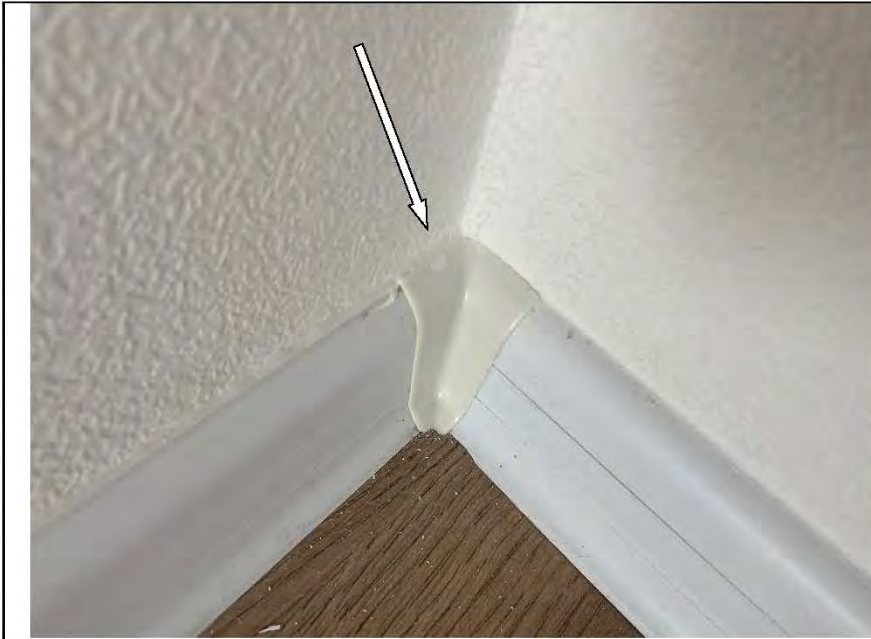
Фото №19. Дефект на напольном плинтусе ПВХ в общей комнате.
