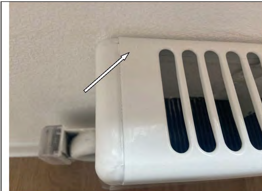
Фото №43. Загрязнения на поверхности металлического кожуха отопительного прибора в общей комнате.
