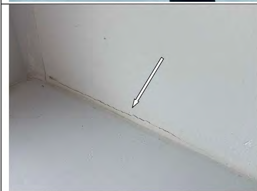
Фото №27. Неровности, выбоины, раковины на окрашенных откосах оконного блока ПВХ в общей комнате.
