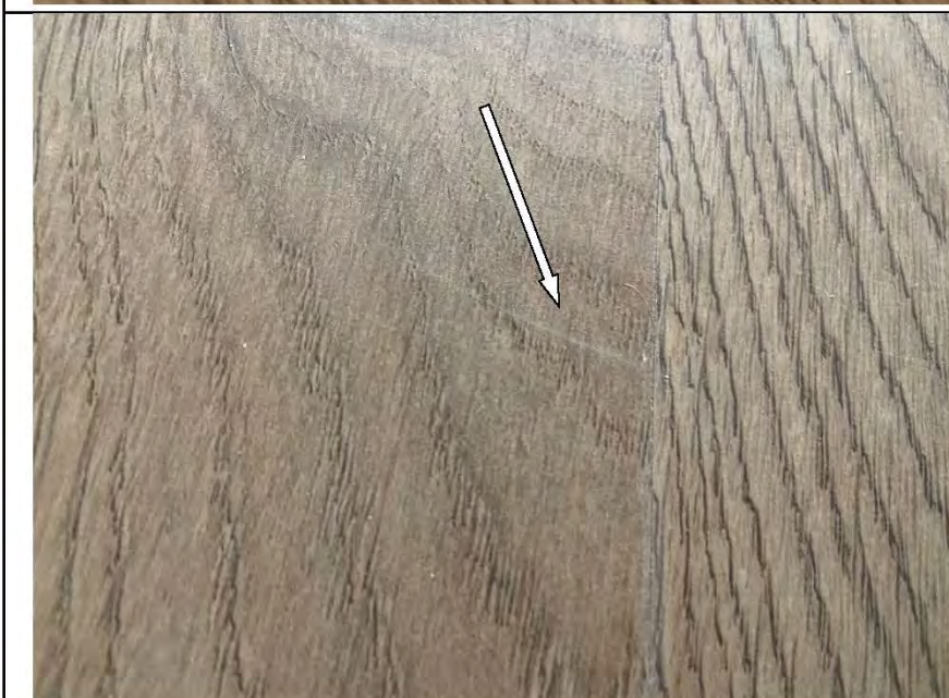
Фото №21. Дефект на напольном покрытии из ламината в коридоре.
