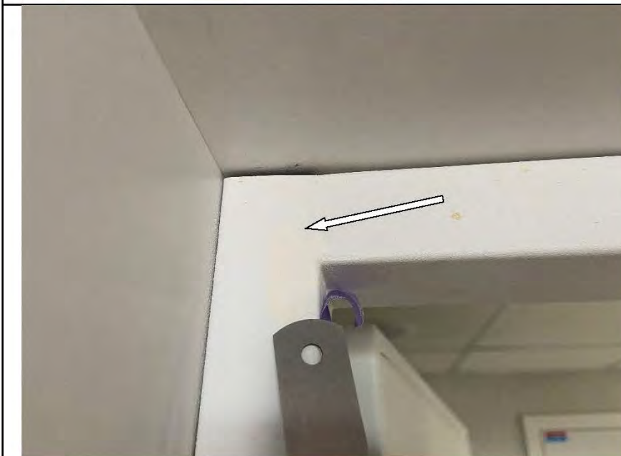
Фото №33. Дефект на коробке входного дверного блока в коридоре.
