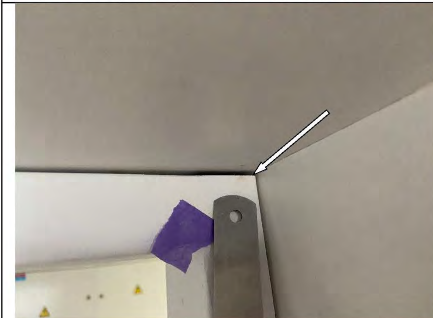
Фото №32. Дефект на коробке входного дверного блока в коридоре.
