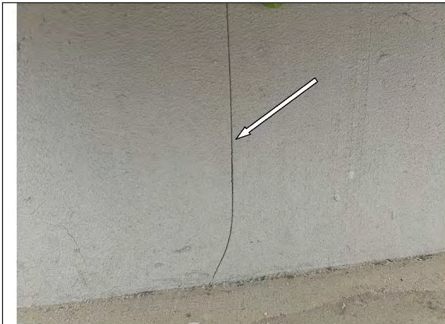
Фото №13. Трещина по оштукатуренному покрытию стен в спальне.
