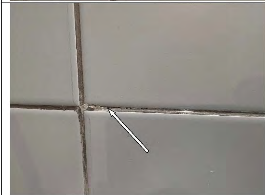
Фото №21. Трещина затирочного раствора шовного пространства настенной керамической плитки в ванной комнате.
