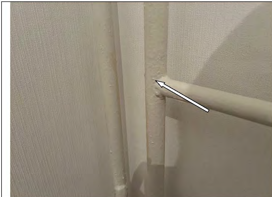
Фото №76. Подтеки краски на трубах отопления в спальне.
