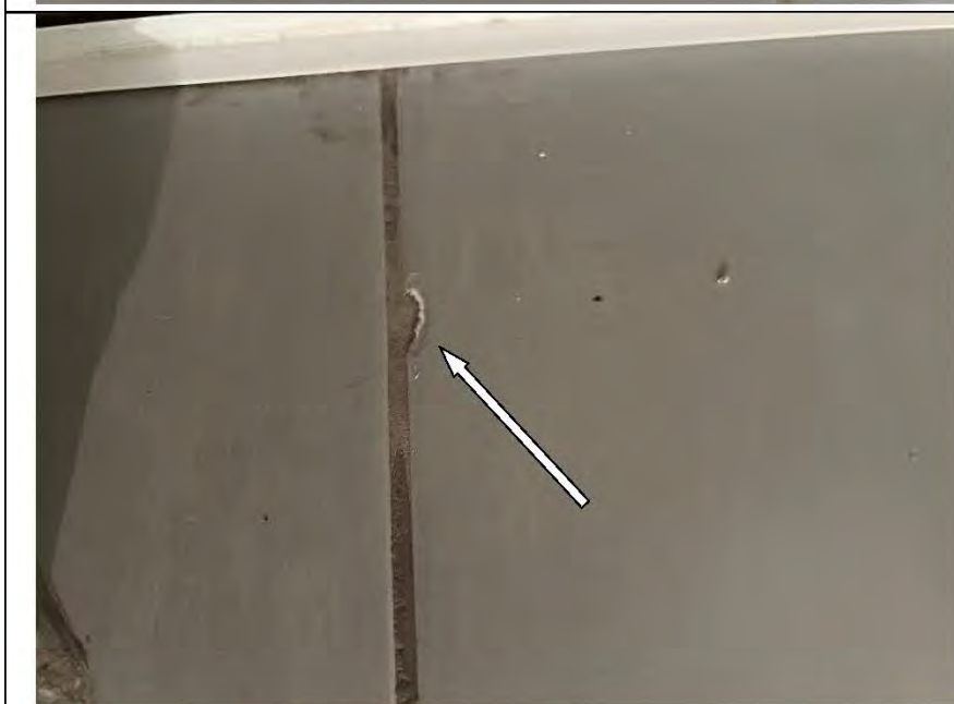
Фото №20. Скол настенной керамической плитки в санузле.
