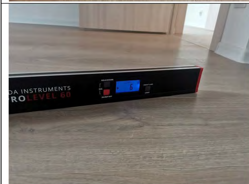
Фото №23. Отклонение по вертикали напольного покрытия из ламината в кабинете.
