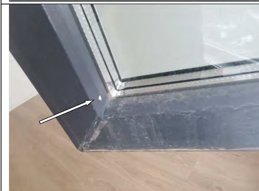
Фото №48. Скол внешнего профиля оконного ПВХ блока в кабинете.
