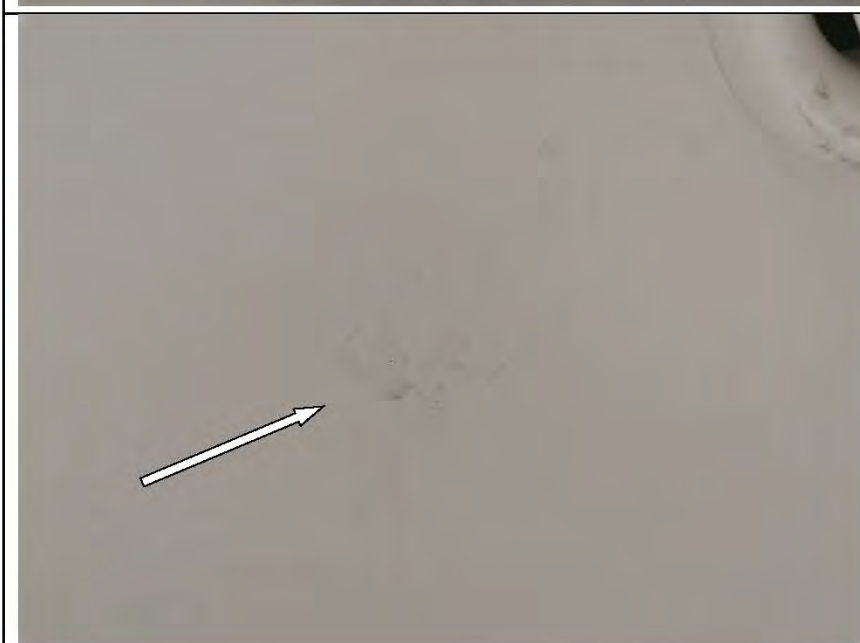
Фото №75. Загрязнение ГКЛ потолка в ванной комнате.
