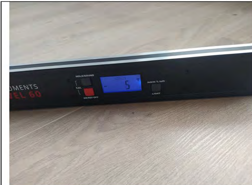
Фото №25. Отклонение по вертикали напольного покрытия из ламината в спальне.
