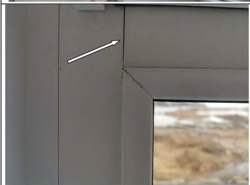
Фото №51. Оконный блок ПВХ имеет дефекты соединений профилей (щель) в гостиной.
