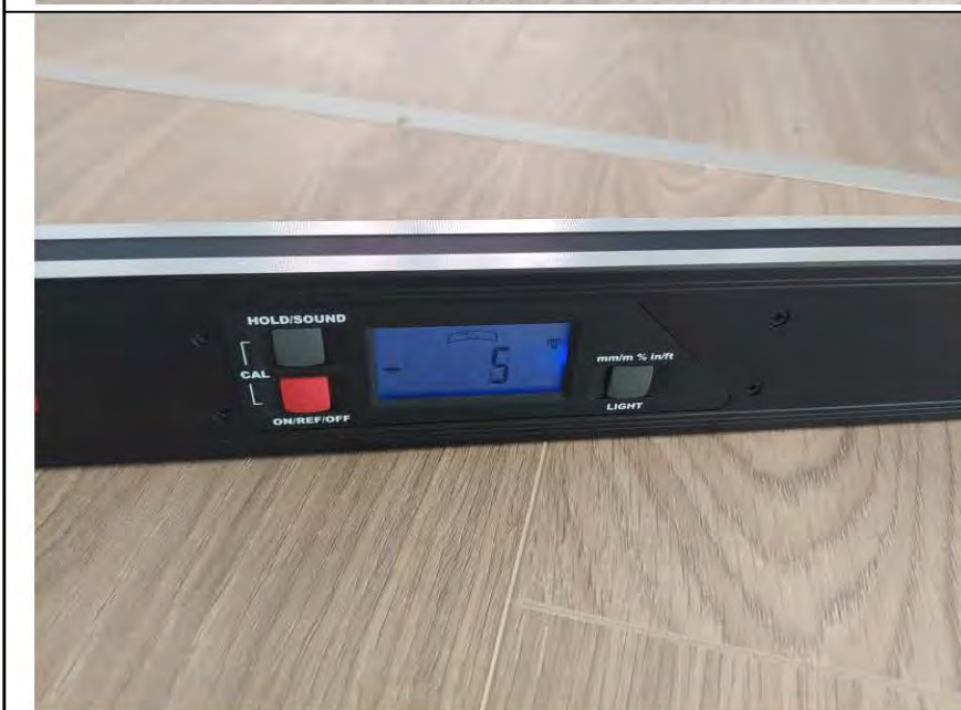
Фото №26. Отклонение по вертикали напольного покрытия из ламината в прихожей.
