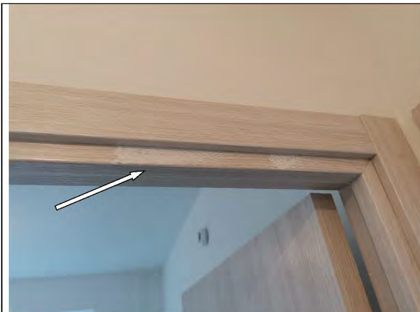
Фото №64. Загрязнение монтажным составом дверного блока кабинета.
