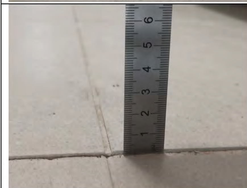
Фото №30. Уступ керамической плитки в ванной комнате.
