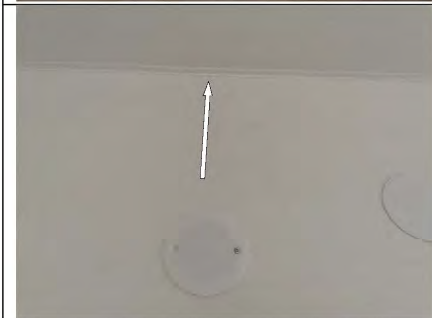
Фото №35. Зазор молдинга натяжного потолка в гостиной.
