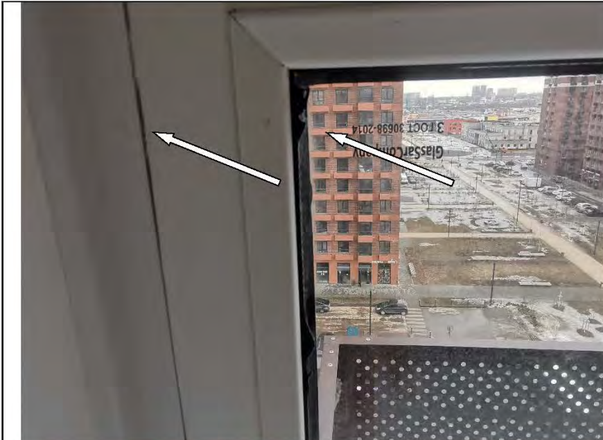
Фото №46. Дефект уплотнительной прокладки в оконном блоке в кабинете.
