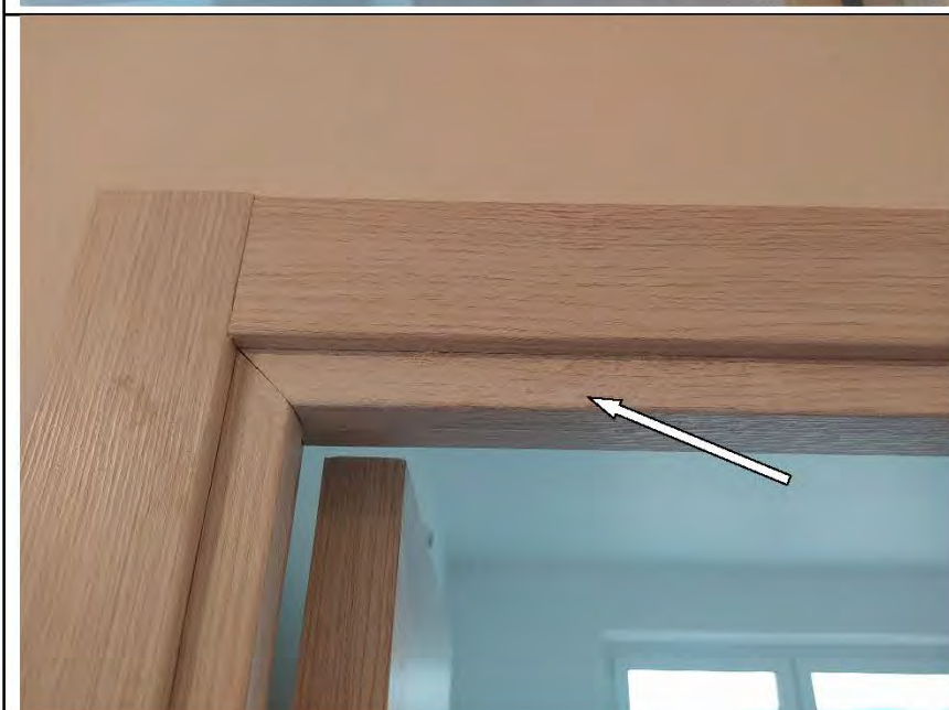
Фото №65. Загрязнение монтажным составом дверного блока спальни.
