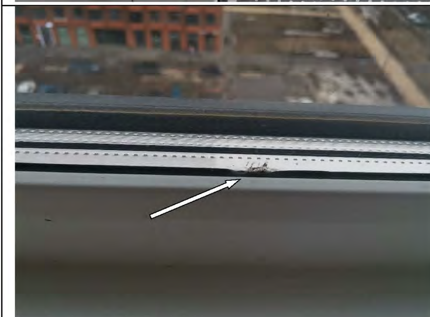
Фото №47. Дефект уплотнительной прокладки в оконном блоке в гостиной.
