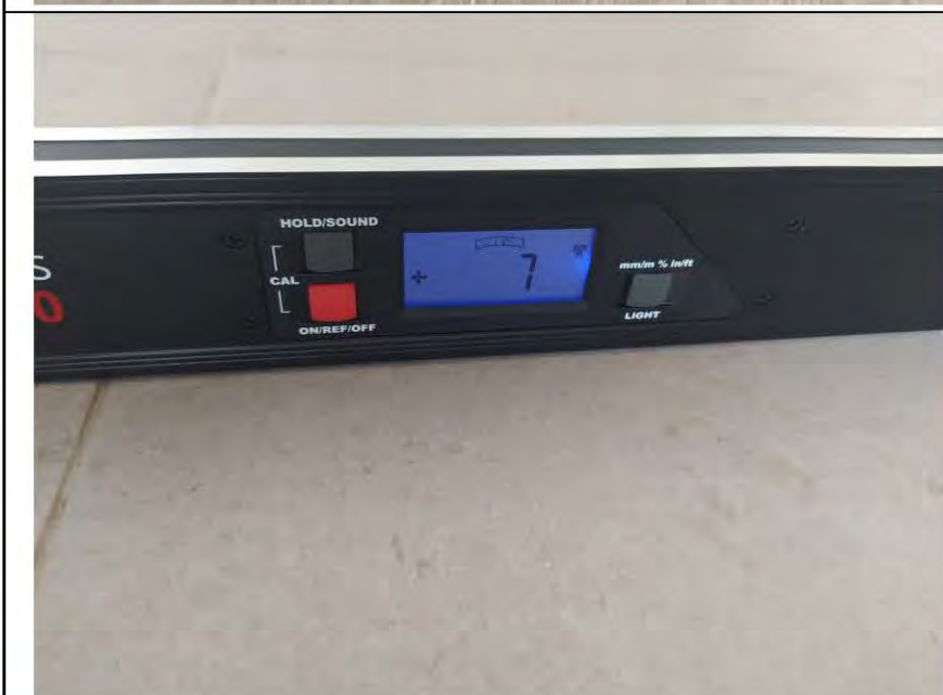
Фото №27. Отклонение по вертикали напольного покрытия из керамической плитки в прихожей.
