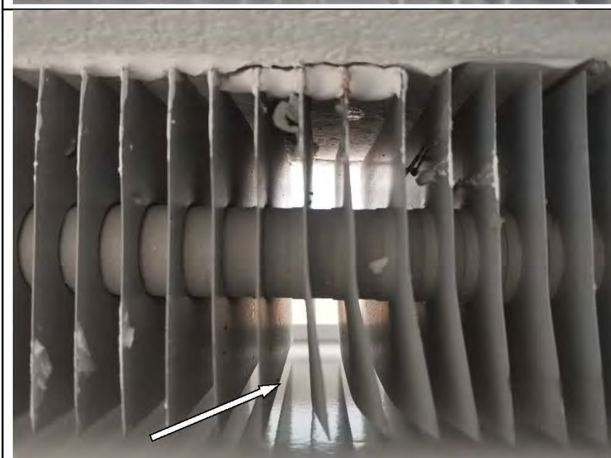
Фото №74. Замятие отопительного прибора в гостиной.
