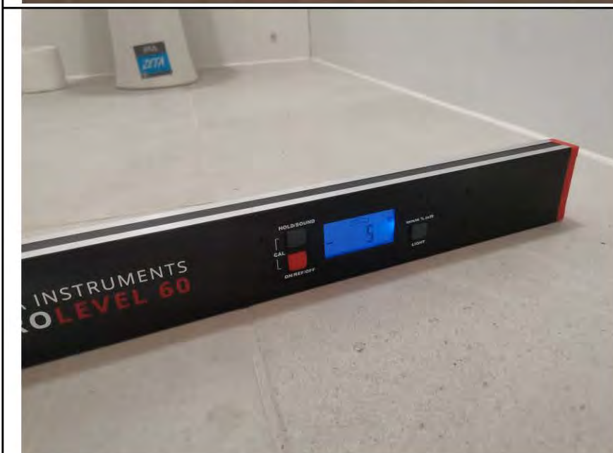
Фото №29. Отклонение по вертикали напольного покрытия из керамической плитки в санузле.
