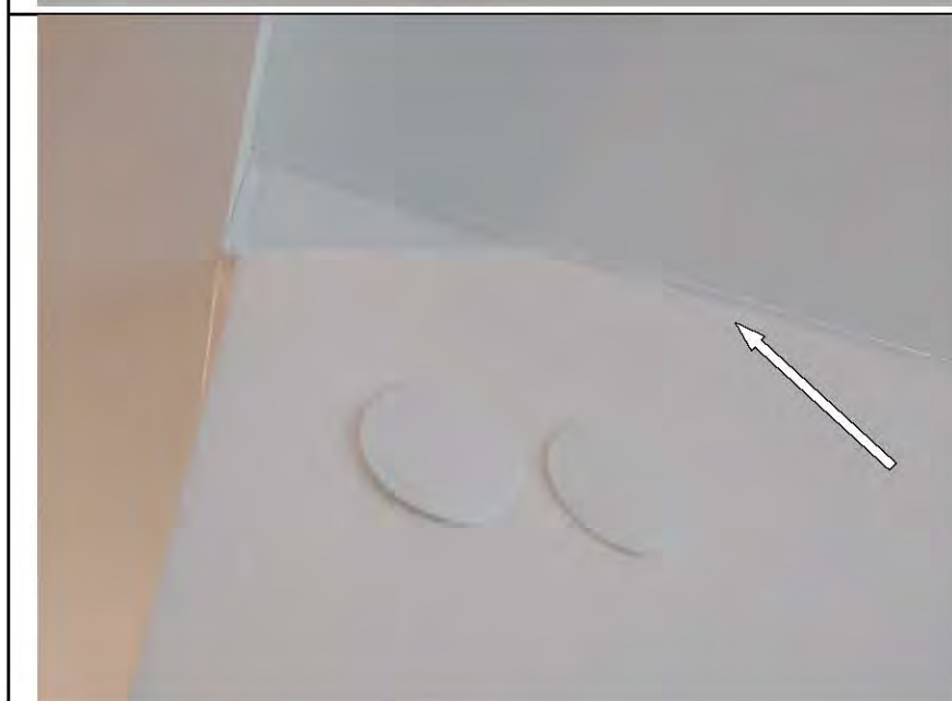
Фото №38. Зазор молдинга натяжного потолка на кухне.
