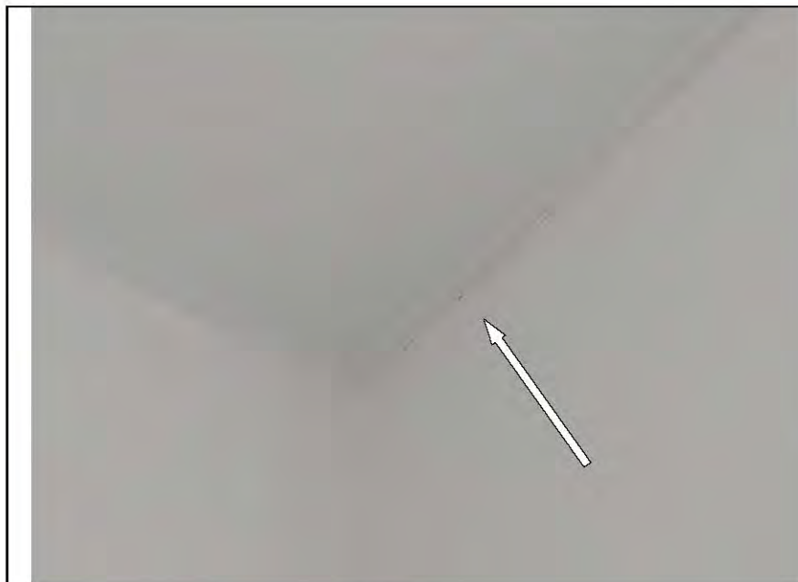
Фото №37. Зазор молдинга натяжного потолка в спальне.
