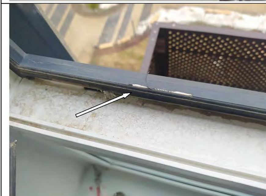
Фото №50. Скол внешнего профиля оконного ПВХ блока на кухне.
