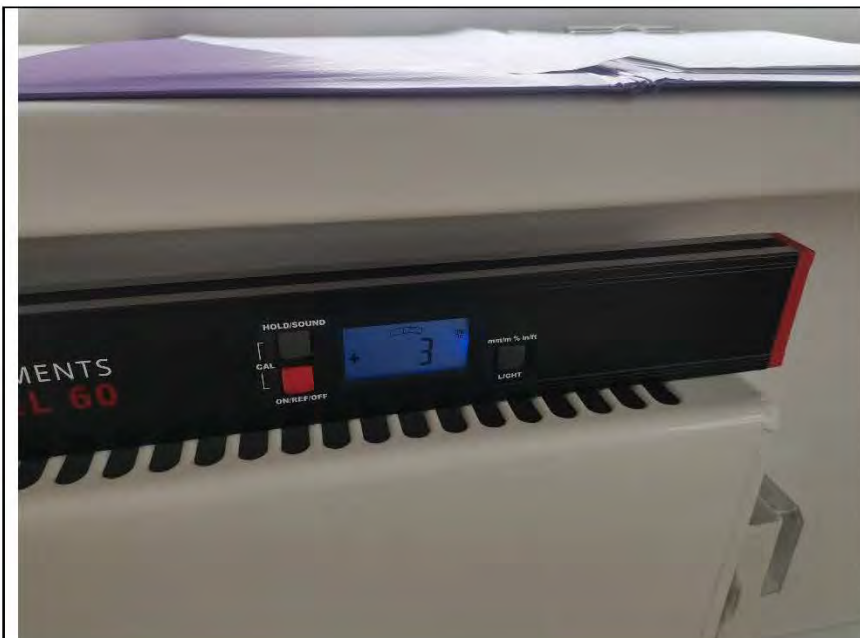
Фото №67. Отопительный прибор в гостиной смонтирован с отклонением по горизонтали.
