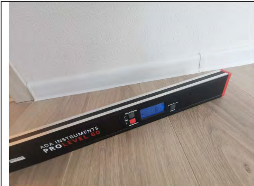
Фото №22. Отклонение по вертикали напольного покрытия из ламината в гостиной.
