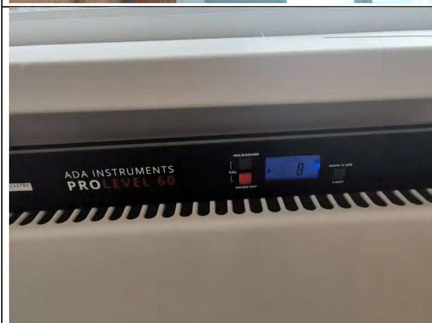
Фото №66. Отопительный прибор в кабинете смонтирован с отклонением по горизонтали.
