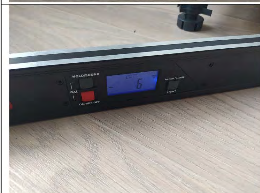
Фото №24. Отклонение по вертикали напольного покрытия из ламината в кухне.
