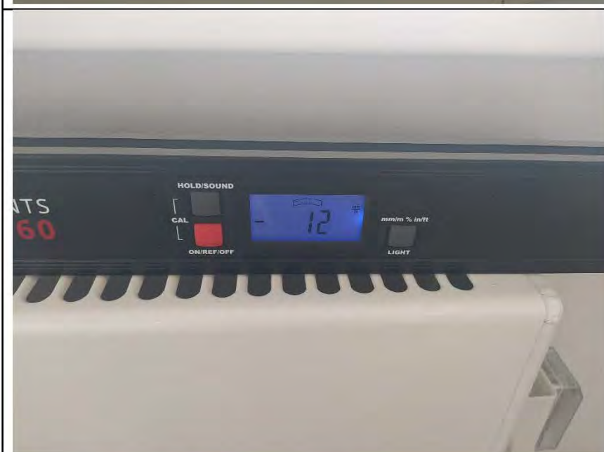
Фото №68. Отопительный прибор на кухне смонтирован с отклонением по горизонтали.
