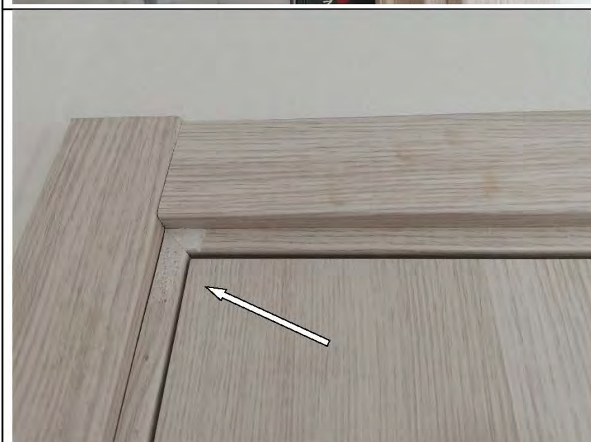
Фото №63. Загрязнение монтажным составом дверного блока гостиной.
