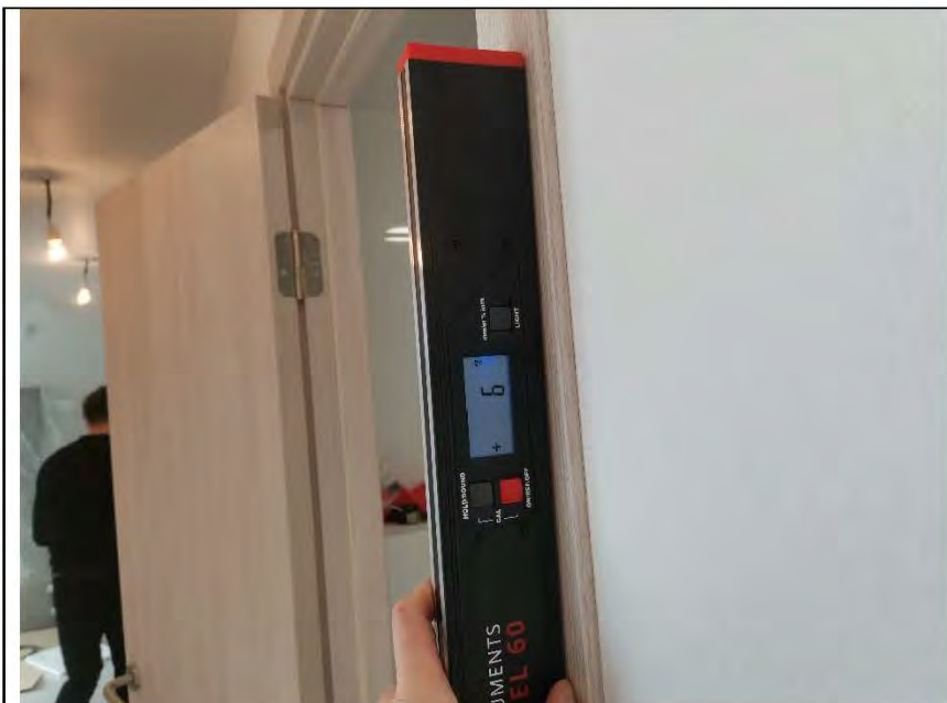
Фото №58. Отклонение наличников дверного блока в ванной комнате.
