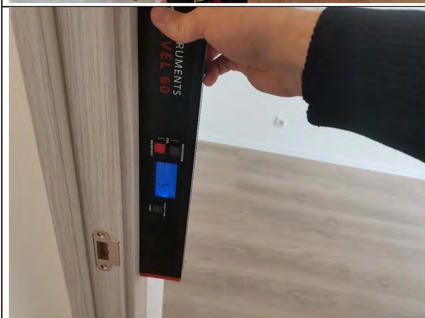
Фото №60. Отклонение коробки дверного блока в кабинете.
