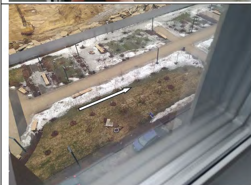
Фото №45. Царапина на внешнем стекле оконного блока в спальне.
