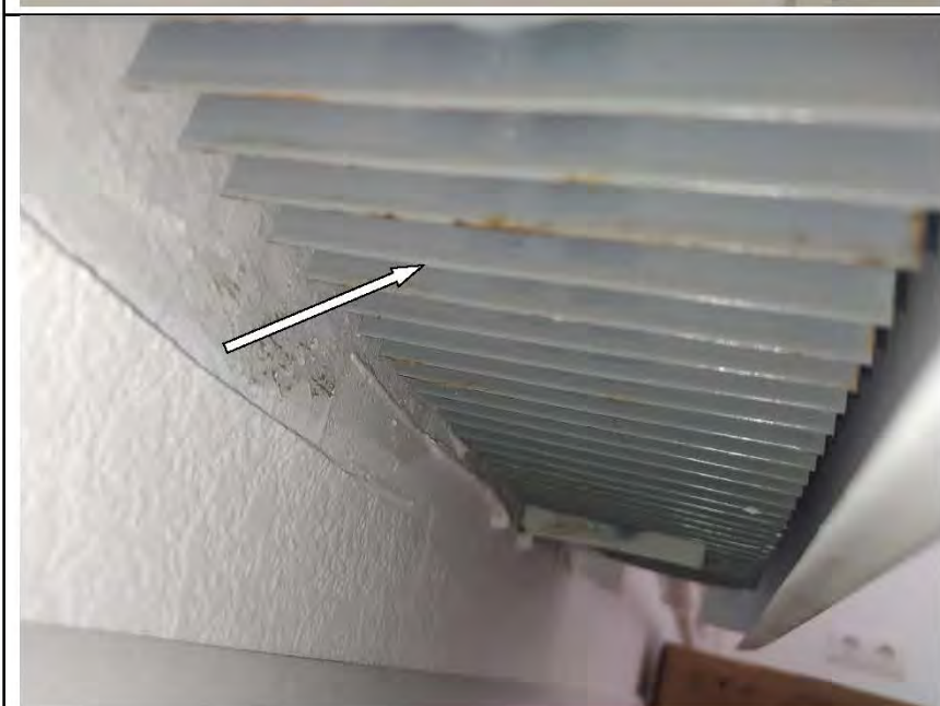
Фото №69. Коррозия отопительного прибора в спальне.
