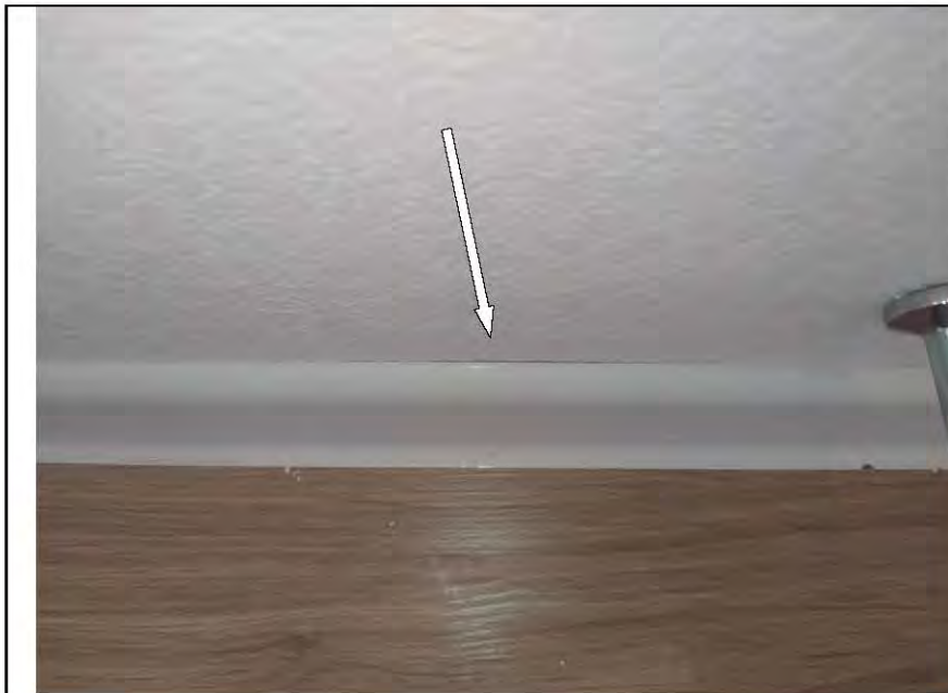
Фото №34. Напольный плинтус ПВХ в прихожей, неплотно прилегает к стене (отходит), образуется зазор
