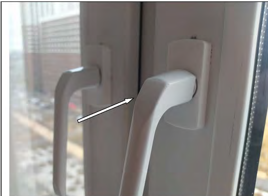
Фото №43. Царапины на фурнитуре оконного блока ПВХ в кухне.
