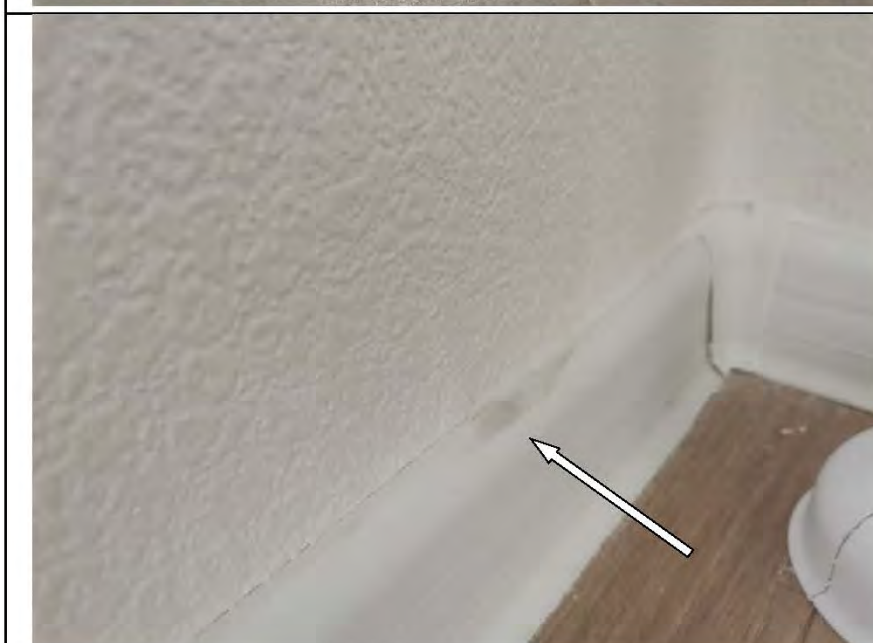
Фото №33. Загрязнение напольного плинтуса ПВХ в гостиной.
