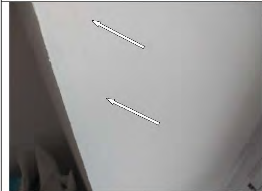
Фото №41. Дефекты окраски откосов в спальне.
