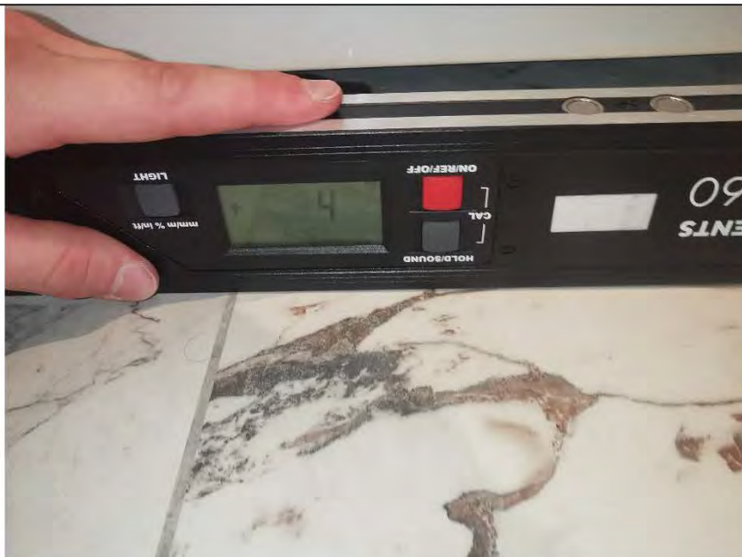
Фото №28. Отклонение уровня пола в ванной комнате.
