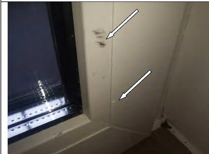
Фото №41. Скол и потертости на профиле ПВХ дверного блока в кухне.
