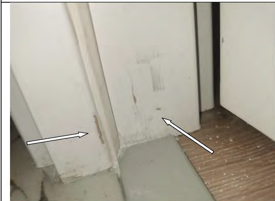
Фото №53. Загрязнения и потертости на коробе деревянного дверного блока в спальне.
