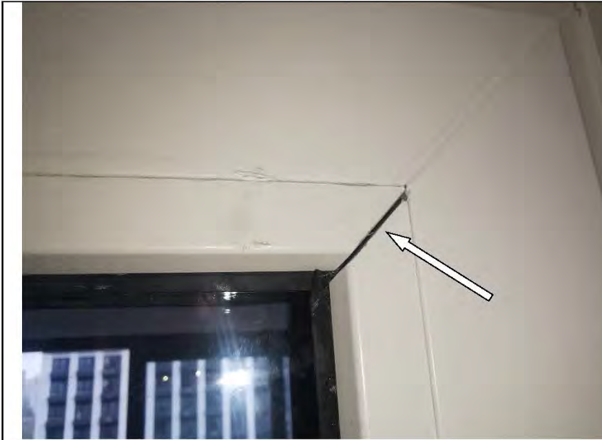
Фото №40. Зазор в месте стыка профилей ПВХ оконного блока в кухне.
