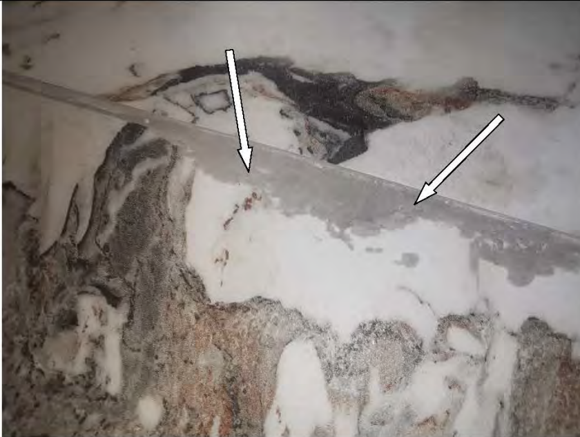
Фото №34. Загрязнение затирочным раствором напольной керамической плитки в ванной комнате.
