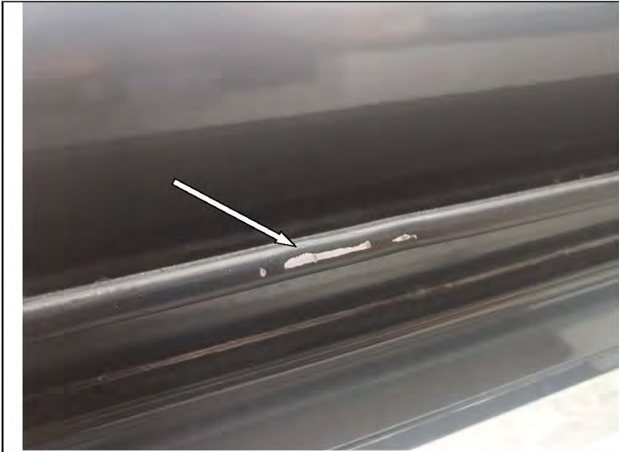
Фото №49. Потертости на профиле металлического оконного блока на лоджии.
