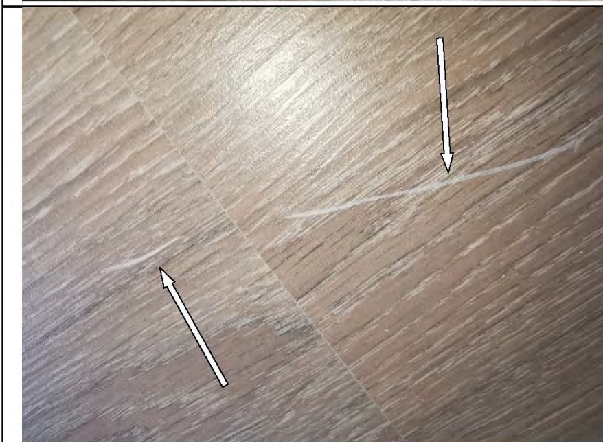
Фото №24. Царапины на ламинате в кухне.
