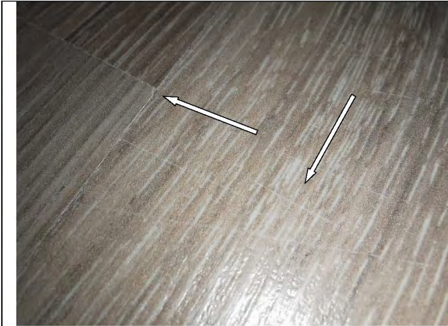
Фото №22. Царапины и сколы на ламинате в спальне.
