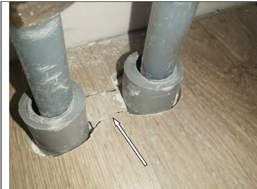
Фото №25. Дефект заделки отверстия для трубопровода отопления в напольном покрытии из ламината в спальне.
