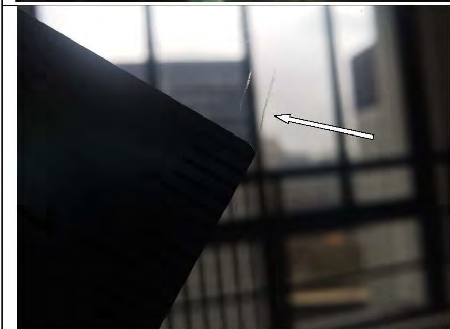
Фото №45. Царапины на стеклопакете ПВХ дверного блока в кухне.
