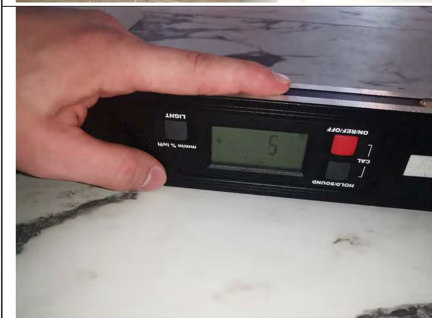
Фото №27. Отклонение уровня пола в коридоре.
