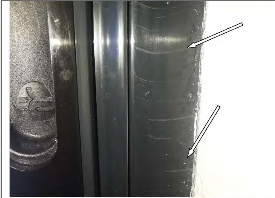
Фото №46. Царапины на профиле металлического оконного блока на лоджии.
