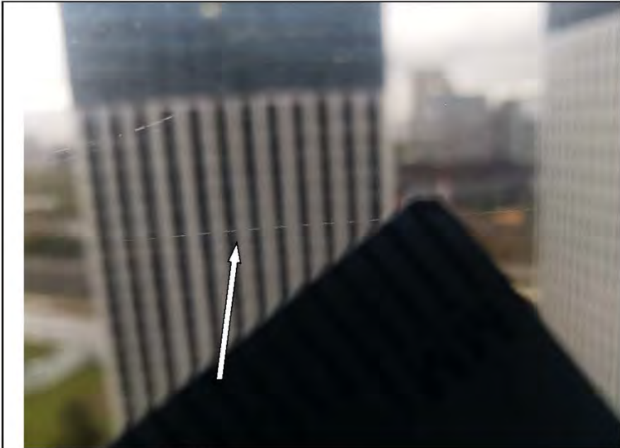
Фото №43. Царапины на стеклопакете ПВХ оконного блока в спальне.
