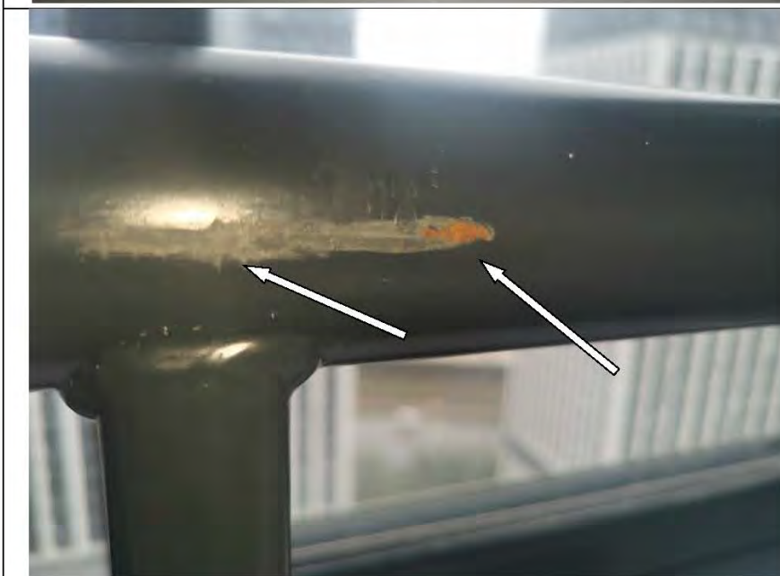
Фото №59. Коррозия на металлическом профиле ограждения лоджии.
