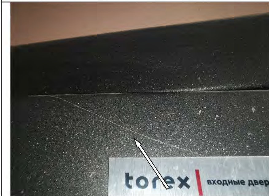
Фото №57. Царапины на полотне входного дверного блока.
