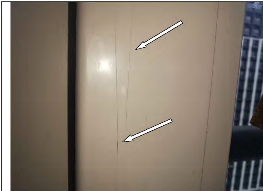
Фото №37. Царапины на профиле ПВХ оконного блока в спальне.
