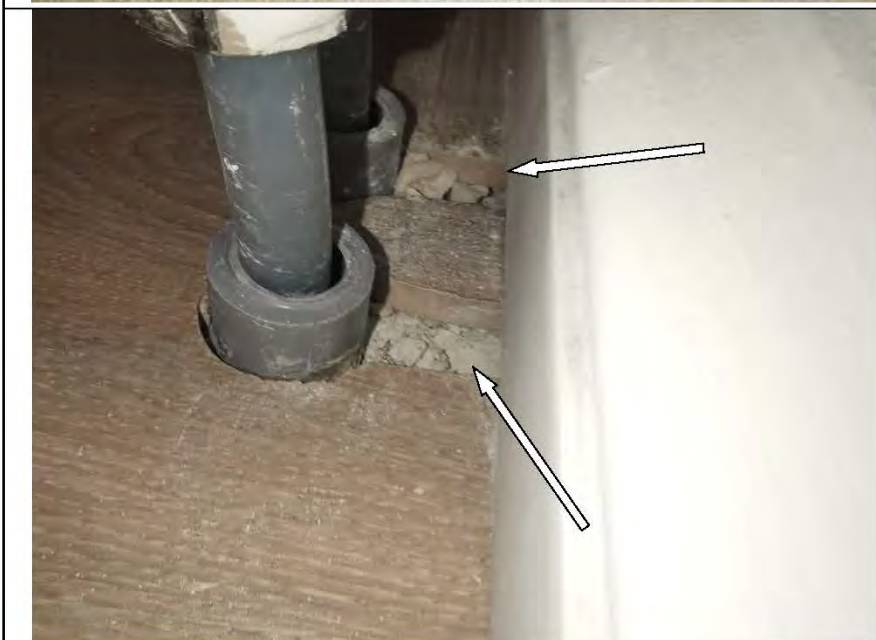
Фото №26. Дефект заделки отверстия для трубопровода отопления в напольном покрытии из ламината в кухне.
