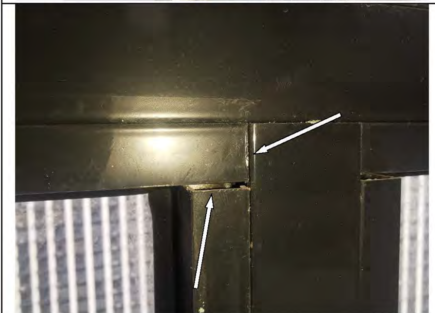
Фото №48. Царапины на профиле металлического оконного блока на лоджии.
