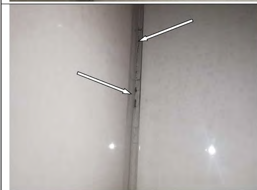
Фото №18. Некачественно выполнена затирка швов настенной керамической плитки в ванной комнате.
