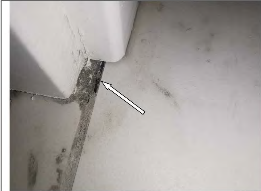
Фото №31. Пропуски затирочного состава в швах напольной керамической плитки в ванной комнате.
