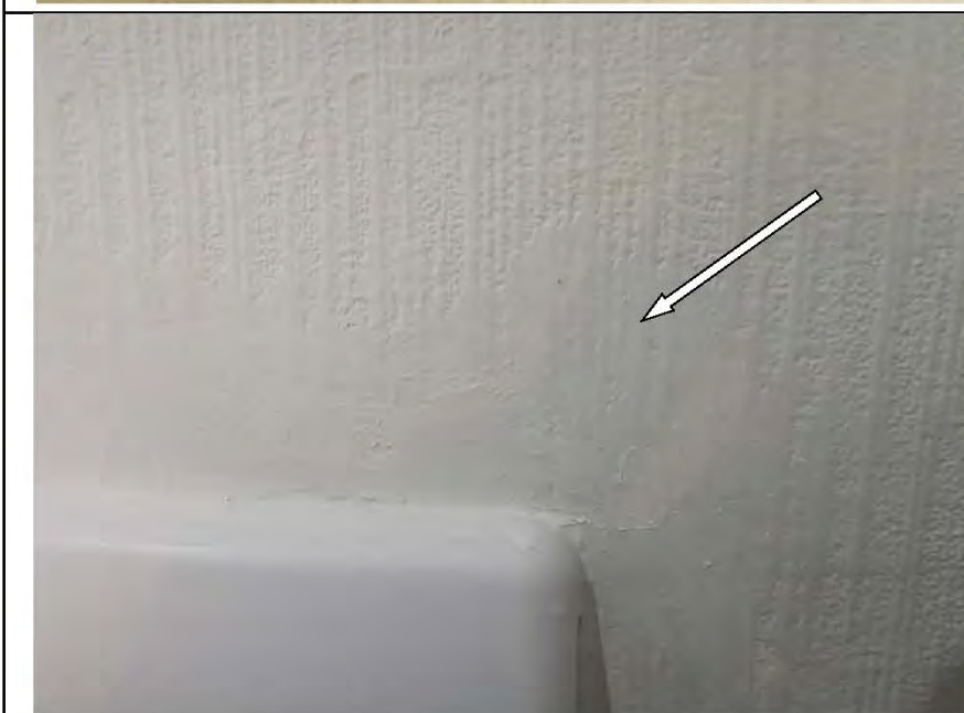
Фото №12. Загрязнение обоевого полотна в коридоре.
