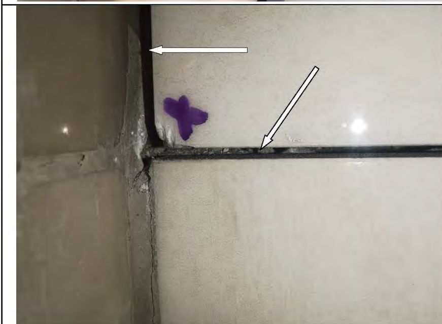
Фото №17. Пропуски затирочного состава в швах настенной керамической плитки в ванной комнате.
