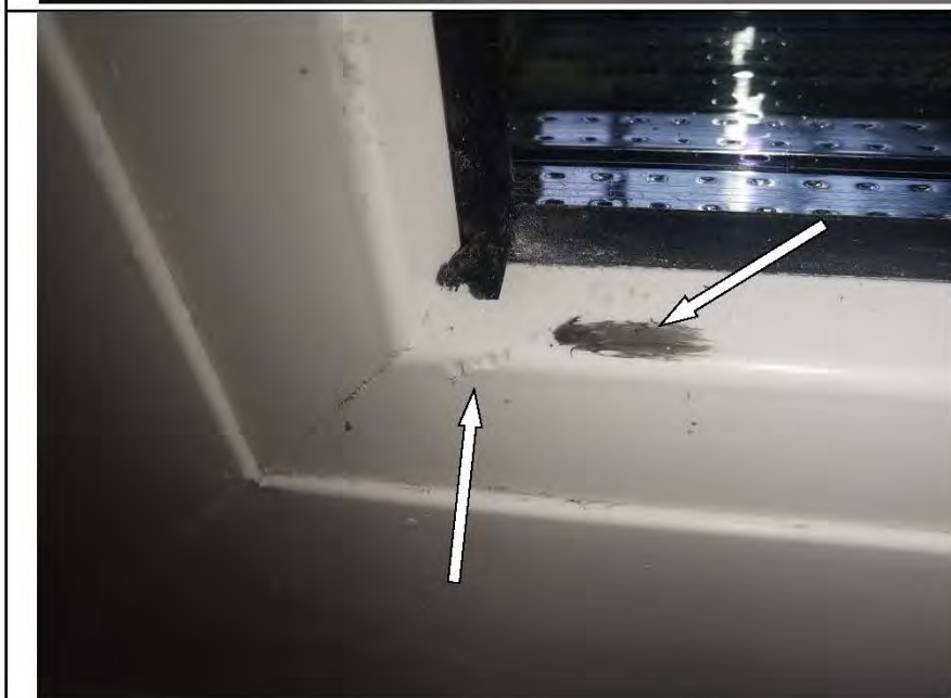
Фото №39. Скол и потертости на профиле ПВХ оконного блока в кухне.
