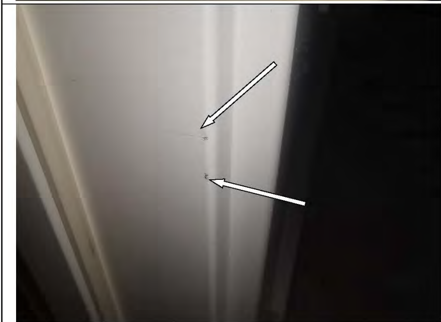
Фото №51. Царапины на коробе деревянного дверного блока в ванной комнате.
