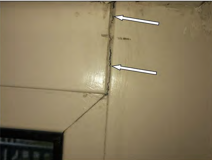
Фото №36. Зазоры в месте стыка профилей ПВХ оконного блока в спальне.
