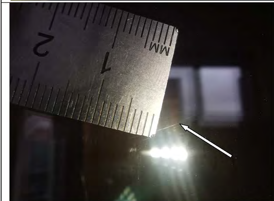
Фото №44. Царапины на стеклопакете ПВХ оконного блока в кухне.
