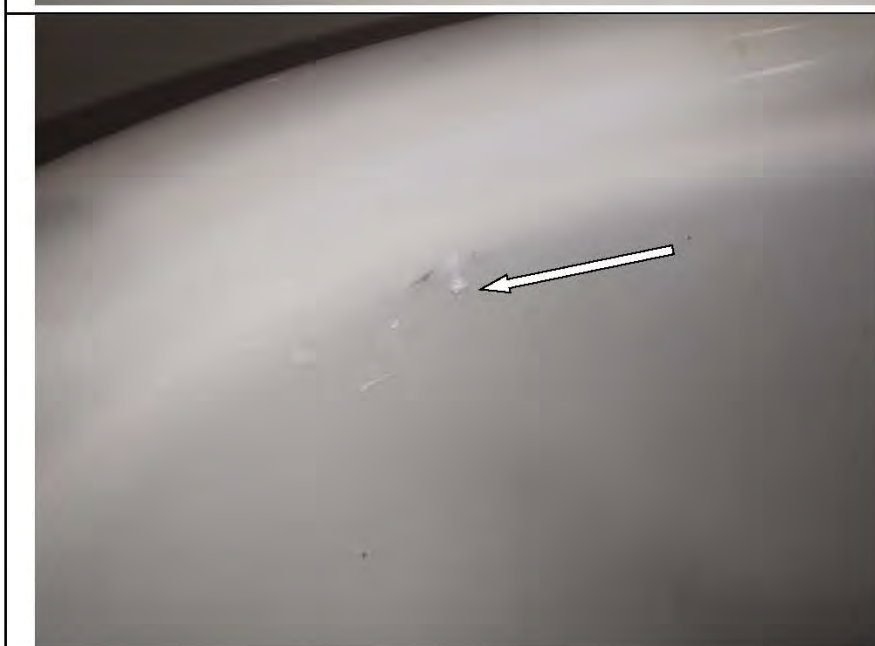
Фото №136. Загрязнения на раковине в санузле.
