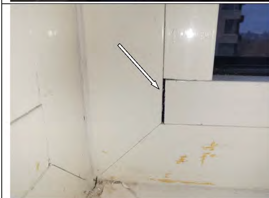
Фото №84. Зазор в месте стыка профилей металлического оконного блока, загрязнение профилей оконного блока в спальне.
