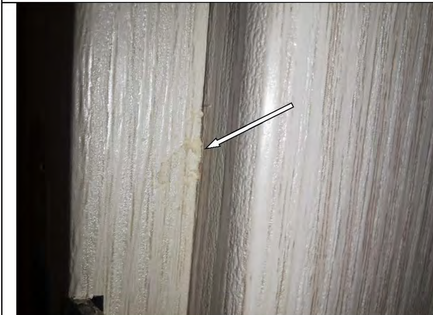
Фото №110. Загрязнения на коробе деревянного дверного блока в санузле.
