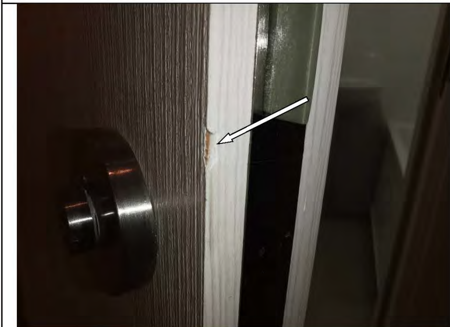
Фото №118. Потертости на полотне деревянного дверного блока в ванной комнате.
