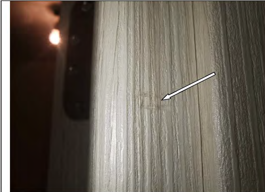
Фото №109. Царапины на коробе деревянного дверного блока в санузле.
