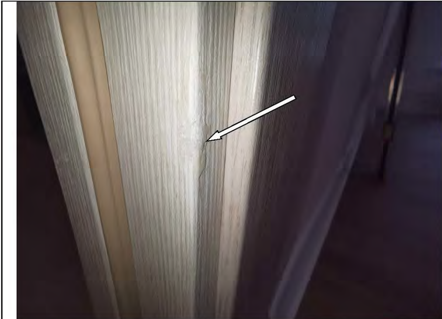
Фото №116. Загрязнение короба деревянного дверного блока в гостиной.
