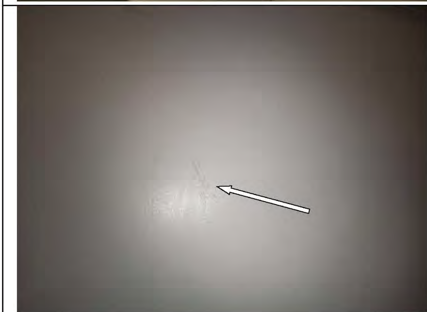
Фото №120. Царапины на полотне входного дверного блока.
