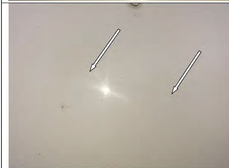
Фото №102. Царапины на металлическом отливе оконного блока в гостиной.
