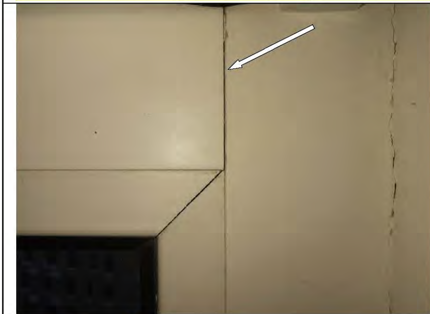
Фото №74. Зазоры в месте стыка профилей ПВХ оконного блока в кухне.
