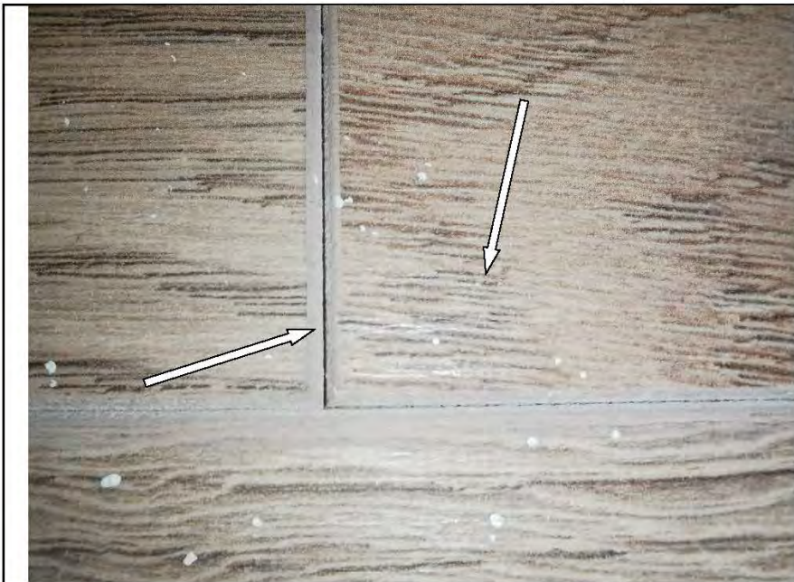
Фото №46. Зазор между соседними досками ламината, загрязнение ламината в спальне.
