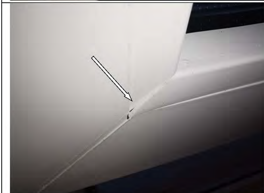
Фото №83. Зазор в месте стыка профилей ПВХ оконного блока в спальне.
