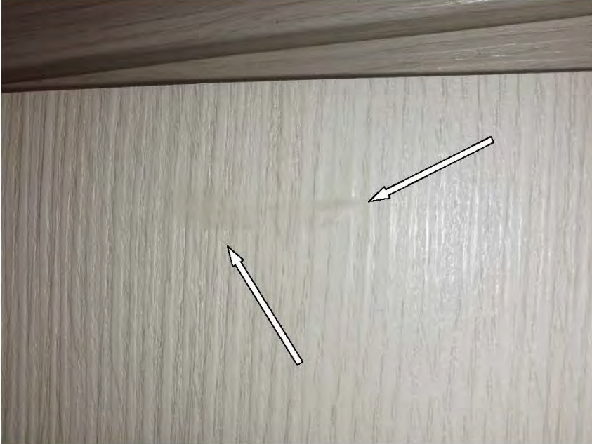
Фото №114. Загрязнения на полотне деревянного дверного блока в детской.
