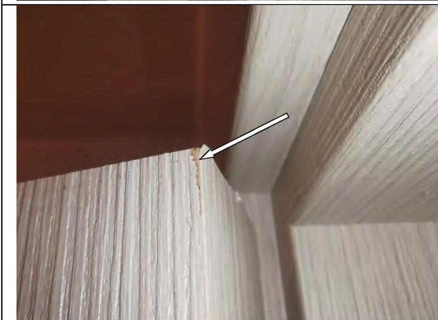
Фото №111. Повреждение ламинации полотна деревянного дверного блока в санузле.
