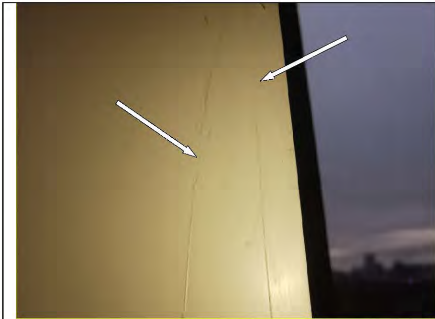
Фото №73. Царапины на профиле ПВХ оконного блока в кухне.
