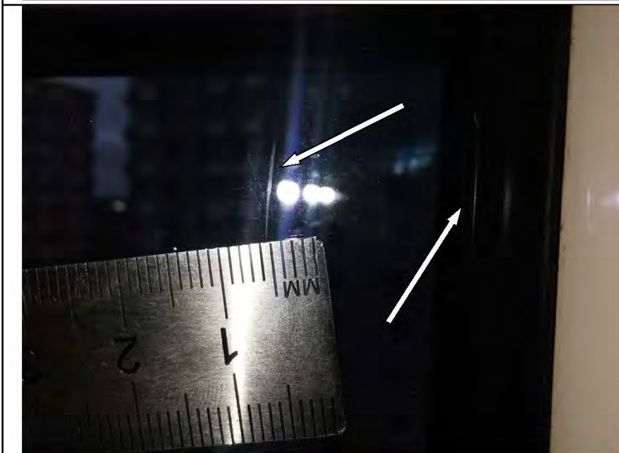
Фото №92. Царапины на стеклопакете металлического оконного блока в гостиной.
