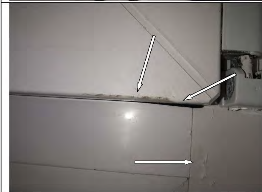
Фото №81. Потертости и загрязнения на профиле ПВХ оконного блока в спальне.
