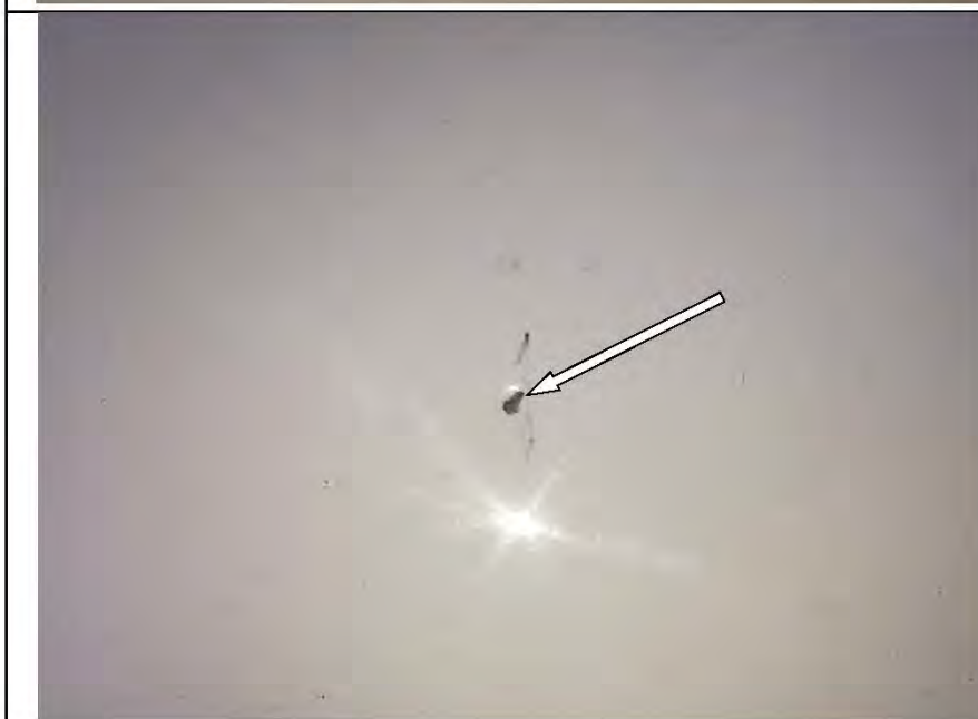
Фото №105. Скол на металлическом отливе оконного блока в спальне.
