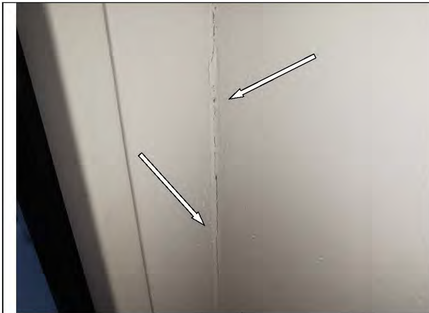
Фото №100. Трещины в месте стыка оконного блока ПВХ и откосов в спальне.
