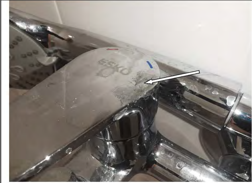
Фото №137. Повреждение эмали на смесителе душевой кабинки в санузле.
