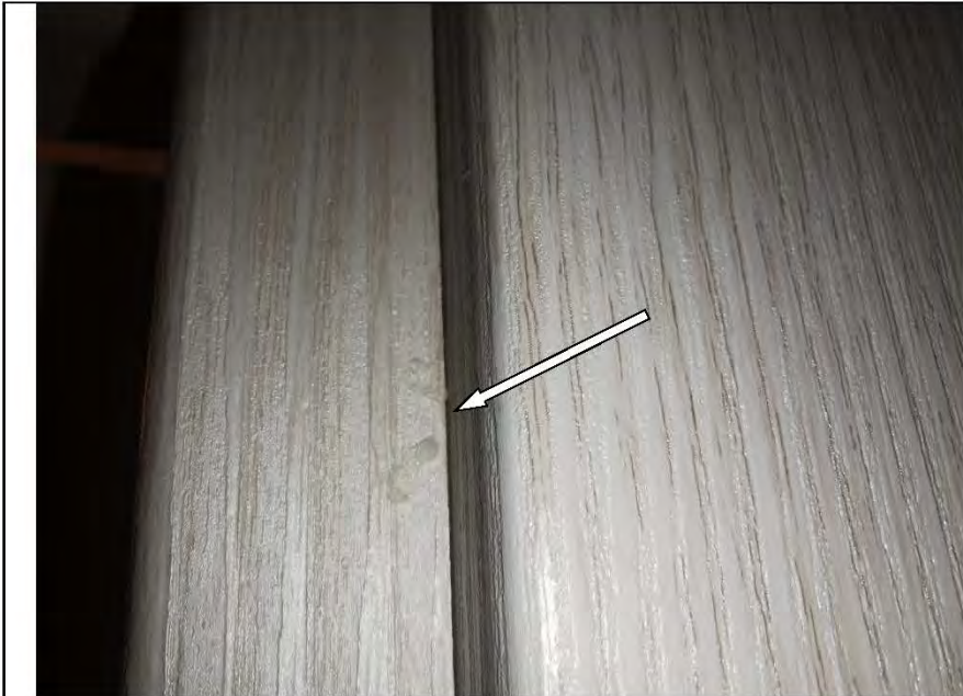
Фото №112. Загрязнения на коробе деревянного дверного блока в постирочной.
