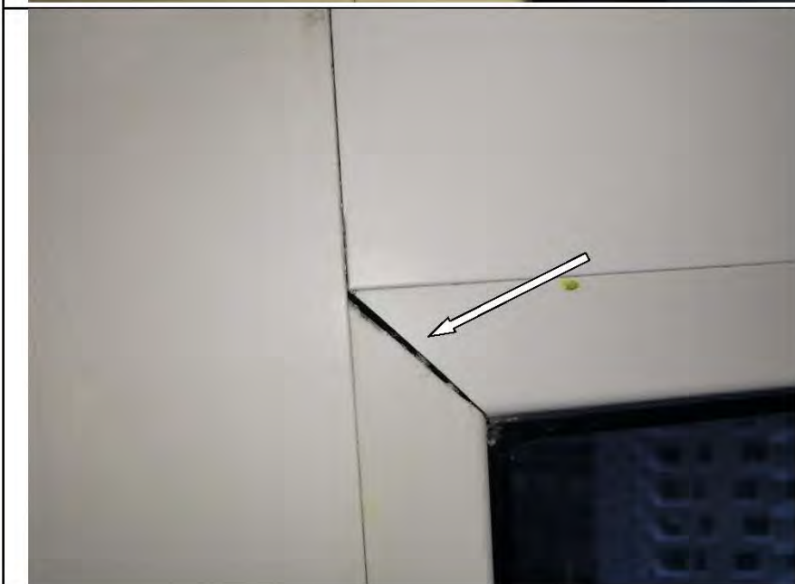
Фото №78. Зазор в месте стыка профилей ПВХ оконного блока в гостиной.
