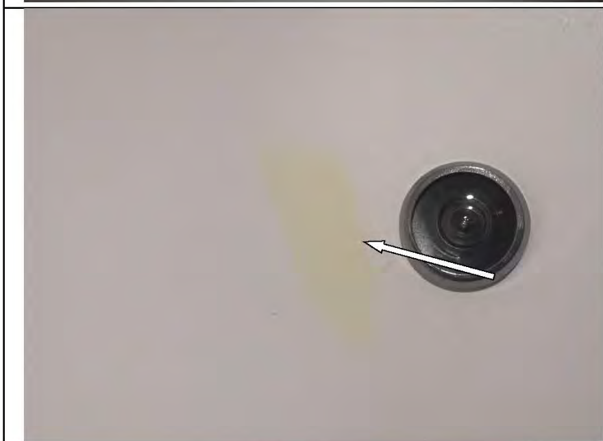
Фото №121. Загрязнение полотна входного дверного блока.
