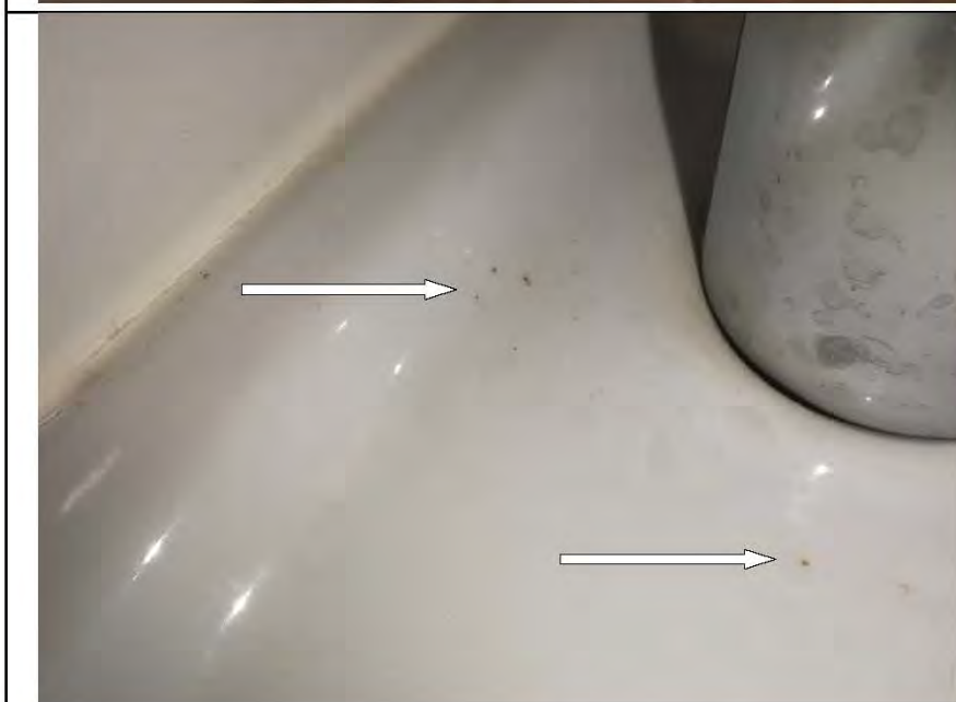
Фото №135. Окалины на раковине в санузле.
