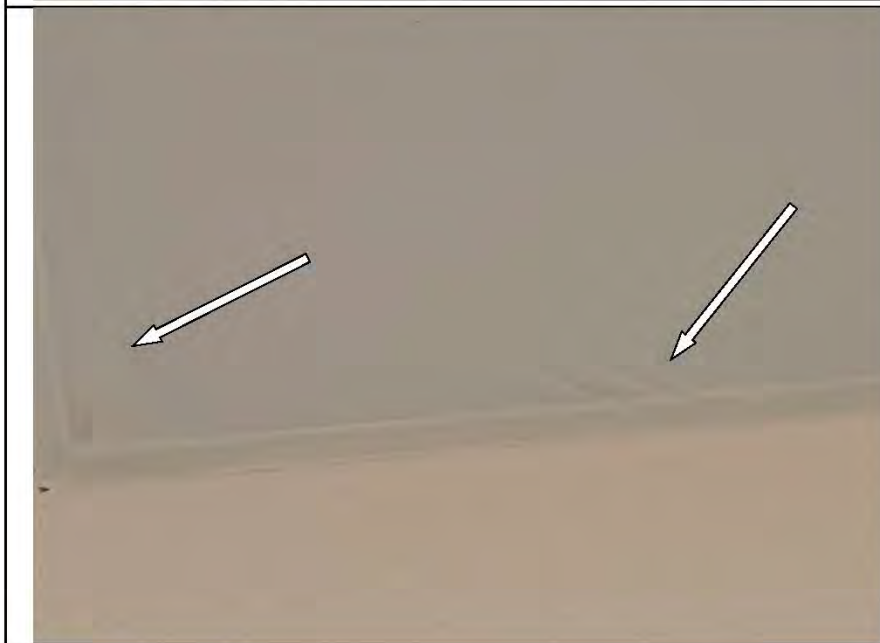
Фото №65. Складки и загрязнение полотна натяжного потолка в прихожей.
