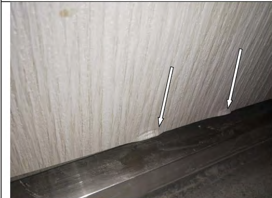
Фото №112. Повреждение ламинации полотна деревянного дверного блока в постирочной.
