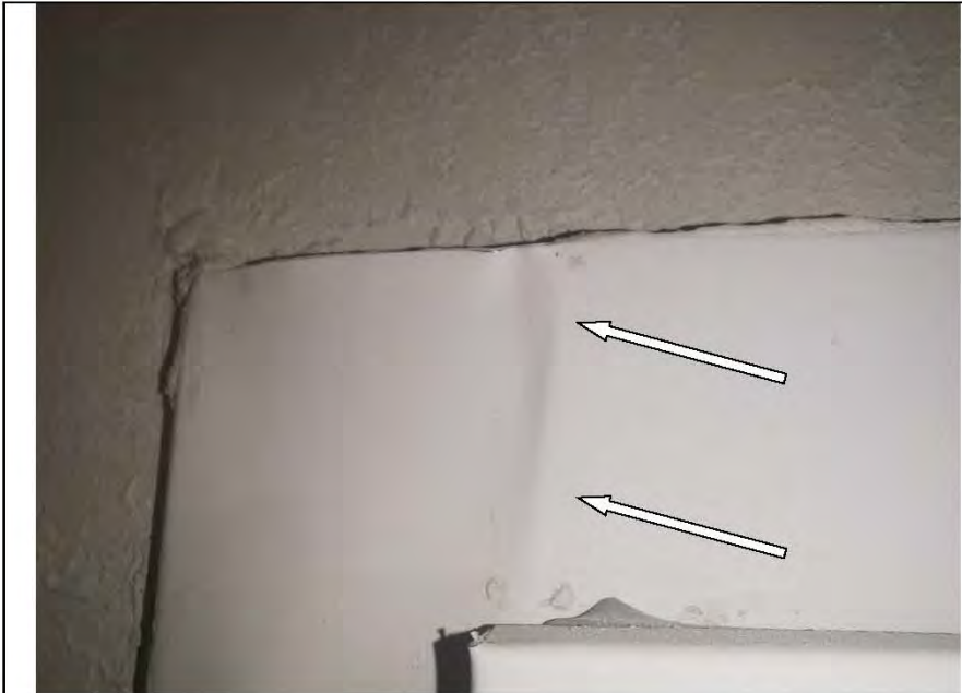
Фото №122. Вмятины на наличниках входного дверного блока.
