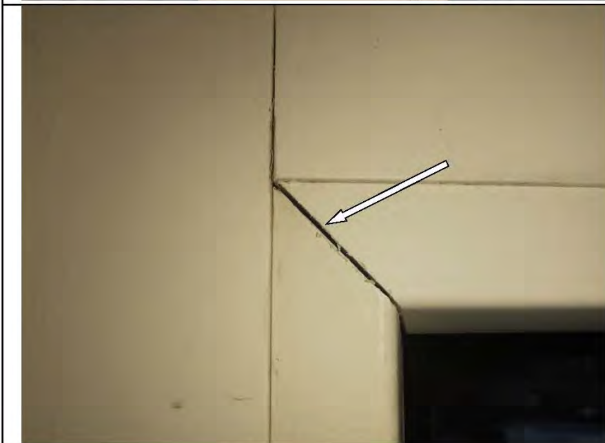
Фото №77. Зазор в месте стыка профилей ПВХ оконного блока в детской.
