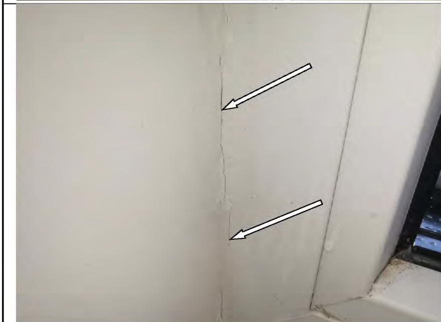
Фото №98. Трещины в месте стыка оконного блока ПВХ и откосов в кухне.
