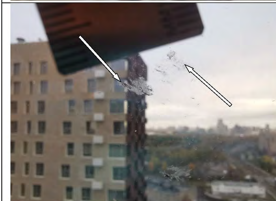
Фото №89. Загрязнения на стеклопакете оконного блока ПВХ в кухне.
