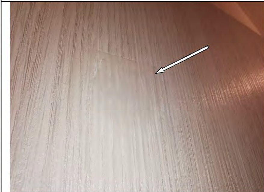
Фото №117. Загрязнение полотна деревянного дверного блока в ванной комнате.
