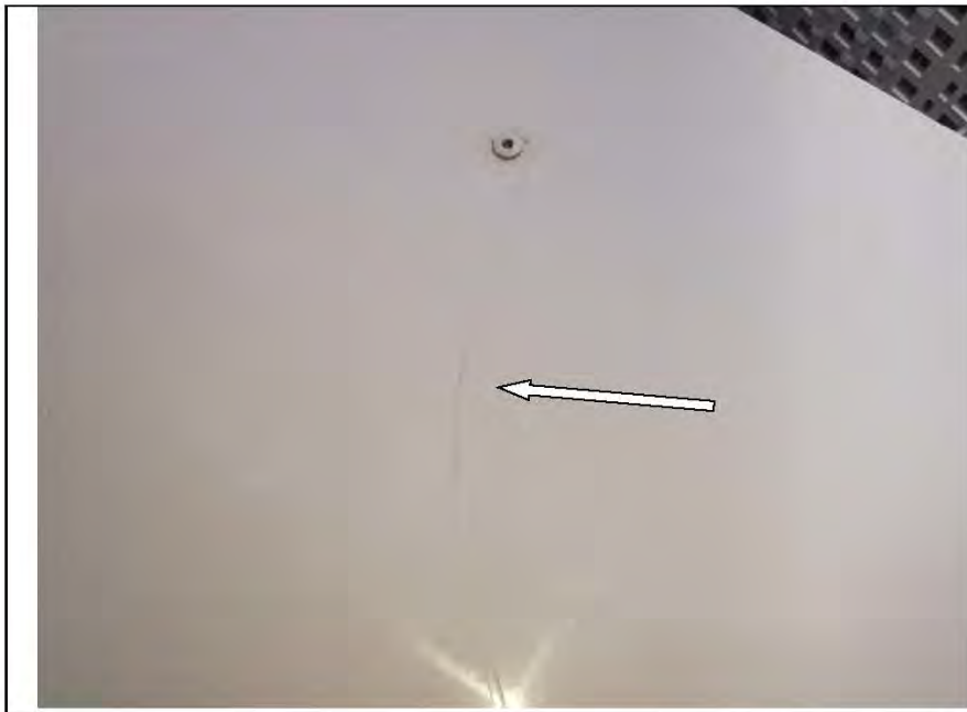
Фото №103. Царапины на металлическом отливе оконного блока в гостиной.
