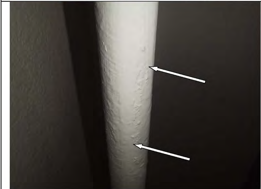
Фото №124. Некачественное окрашивание труб отопления в кухне.
