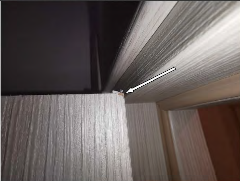
Фото №115. Повреждение ламинации полотна деревянного дверного блока в гостиной.
