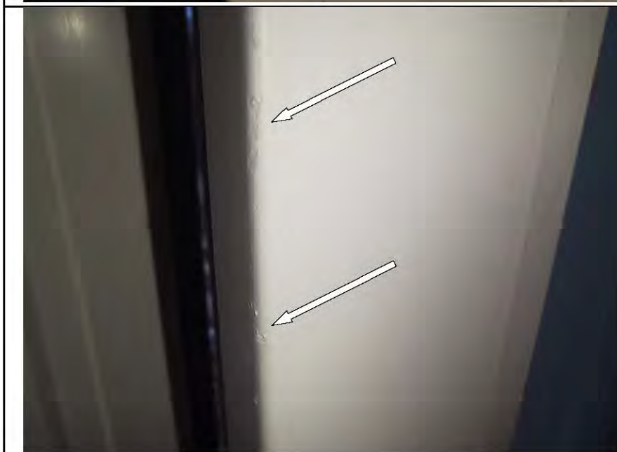
Фото №75. Потертости на профиле ПВХ оконного блока в детской.
