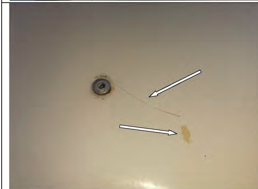
Фото №101. Царапины и загрязнения на металлическом отливе оконного блока в детской.
