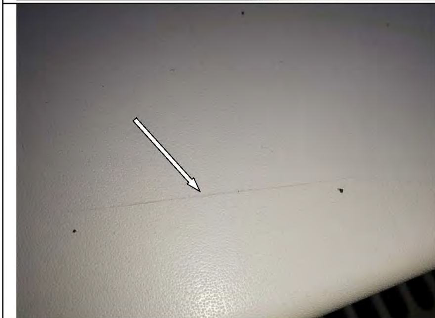
Фото №95. Царапины на лицевой поверхности подоконной доски в гостиной.
