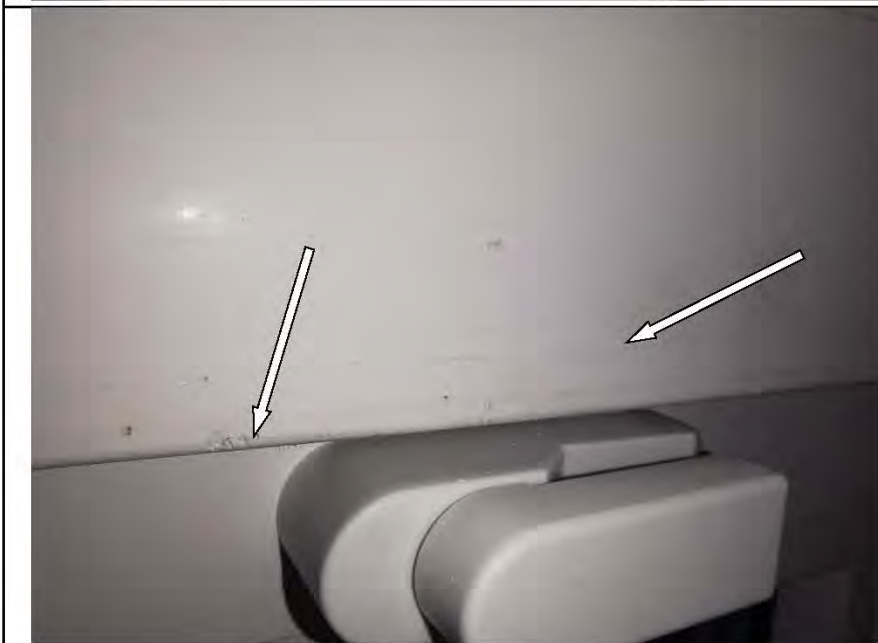
Фото №80. Царапины и сколы на профиле ПВХ оконного блока в гостиной.
