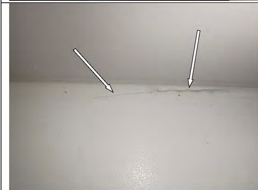
Фото №93. Царапины на лицевой поверхности подоконной доски в кухне.
