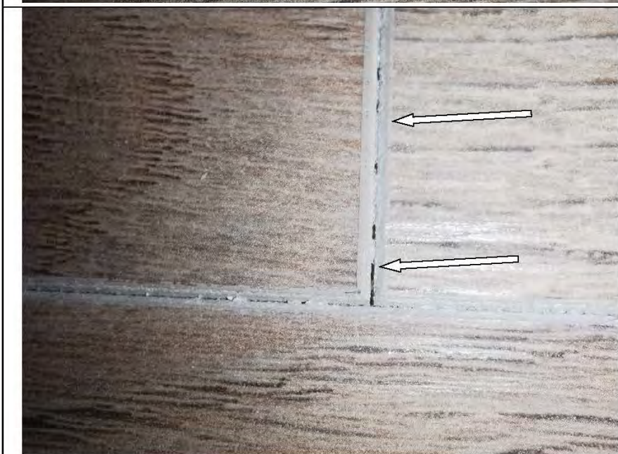
Фото №48. Зазор между соседними досками ламината в гостиной.
