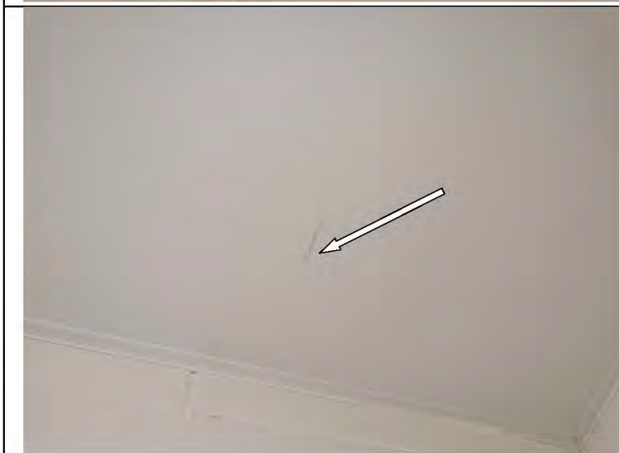
Фото №66. Загрязнение полотна натяжного потолка в постирочной.
