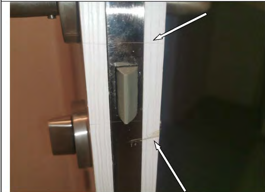
Фото №112. Царапины на полотне деревянного дверного блока в постирочной.
