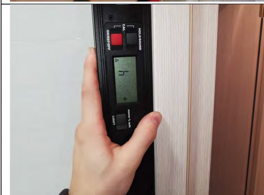
Фото №108. Отклонение коробки деревянного дверного блока от уровня вертикальности в ванной комнате.
