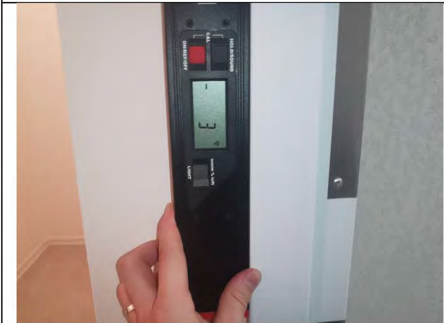
Фото №123. Отклонение коробки входного дверного блока.
