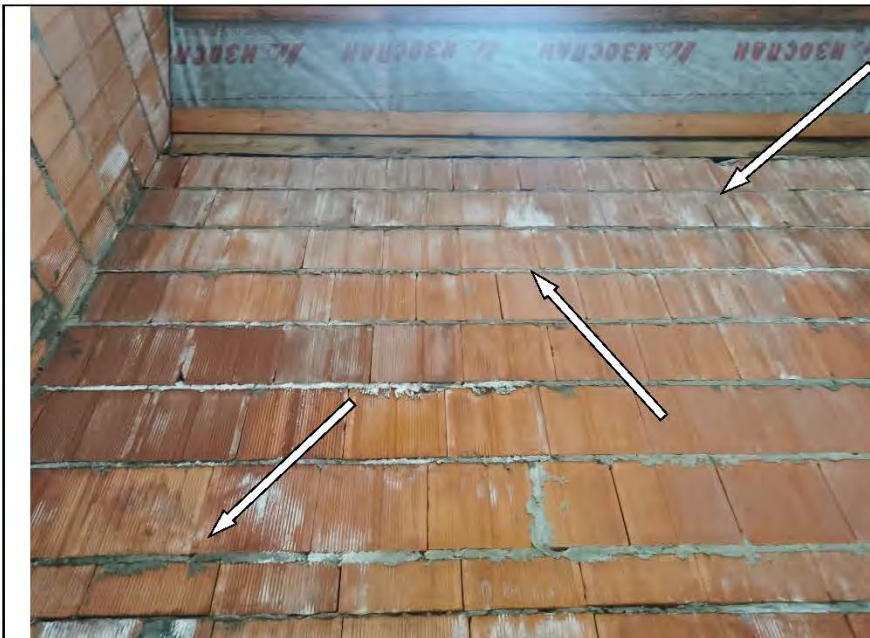
Фото №49. Следы заливки на стенах из кирпичной кладки.
