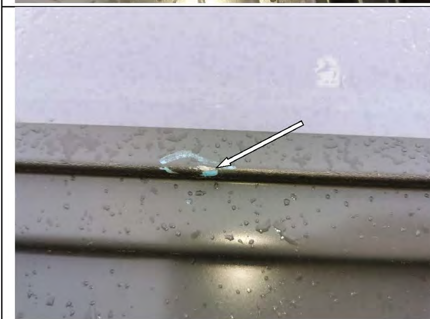
Фото №27. Царапины на профиле металлического оконного блока.
