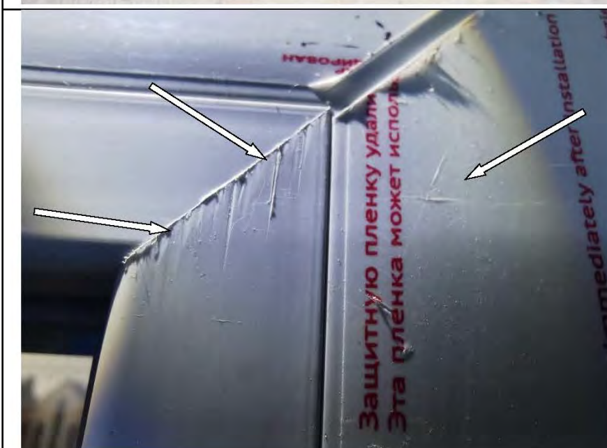
Фото №15. Царапины на профиле ПВХ оконного блока.
