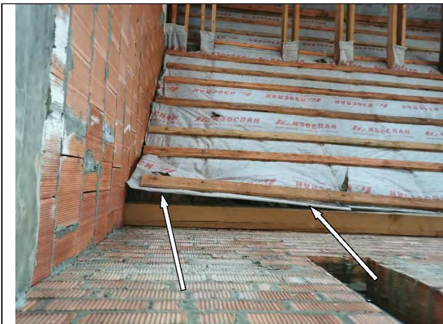
Фото №46. Ненадежное закрепление деревянного элемента стропильной системы (досок обрешетки).
