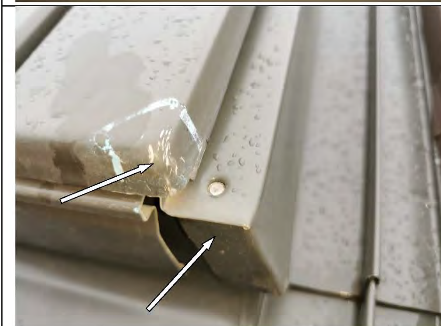
Фото №24. Царапины на профиле металлического оконного блока.
