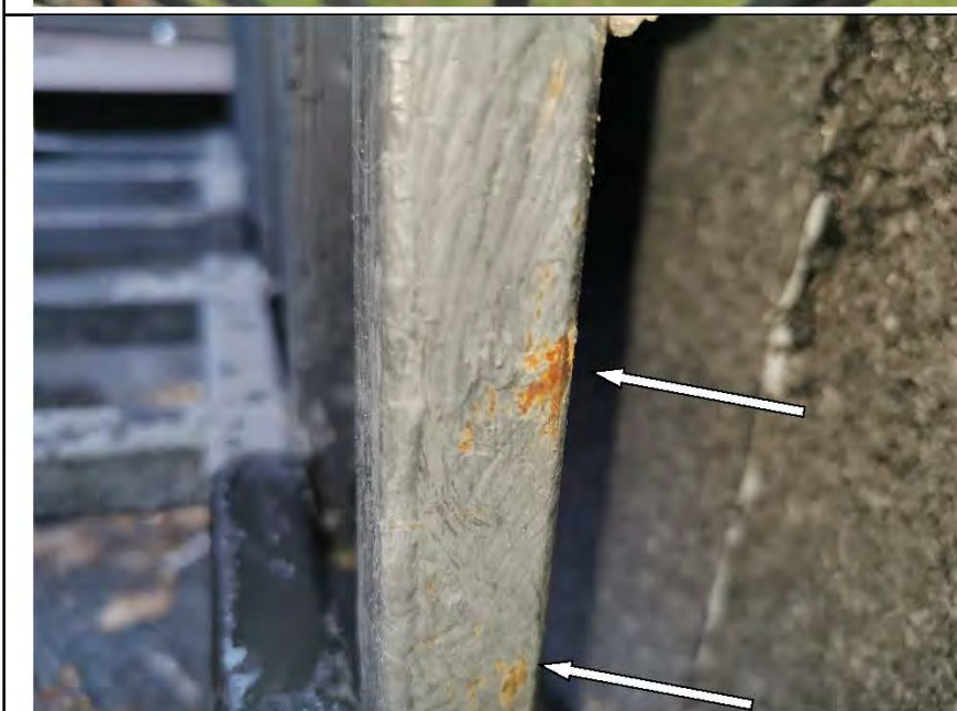
Фото №45. Коррозия на металлическом ограждении дверного блока.
