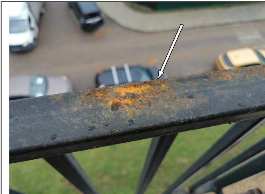
Фото №43. Коррозия на металлическом ограждении оконного блока.
