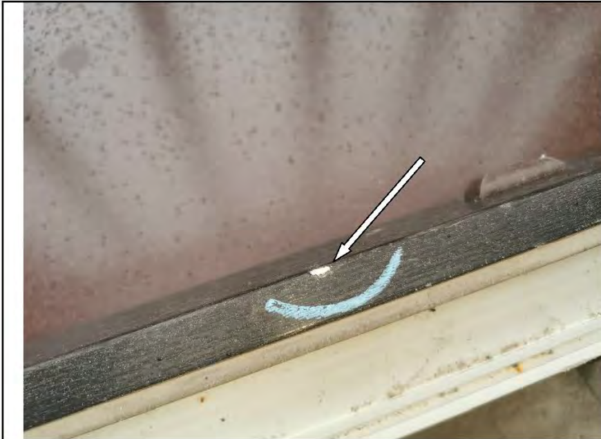
Фото №19. Царапины на профиле ПВХ оконного блока.
