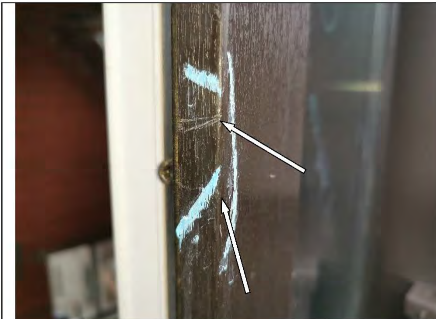
Фото №22. Царапины на профиле ПВХ дверного блока.
