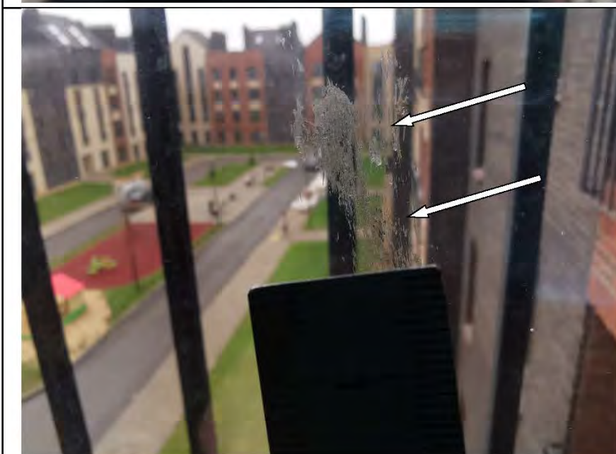
Фото №35. Загрязнения и окалины на стеклопакете оконного блока ПВХ.
