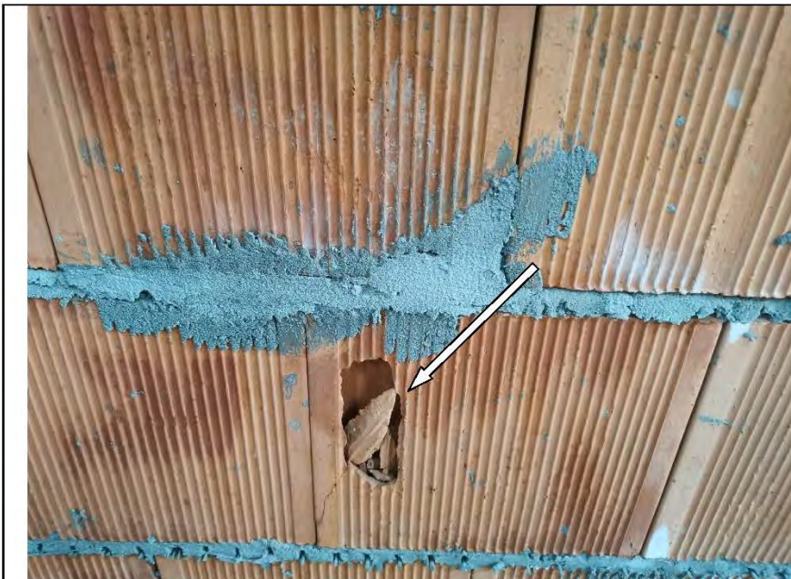
Фото №7. Разрушение конструкции кладки в квартире.
