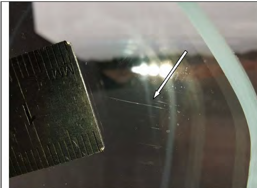
Фото №37. Царапины на стеклопакете дверного блока ПВХ.
