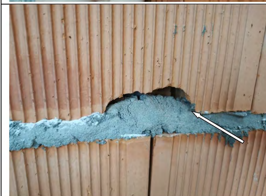
Фото №6. Разрушение конструкции кладки в квартире.
