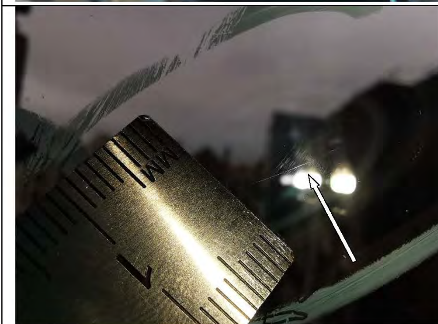
Фото №32. Царапины на стеклопакете оконного блока ПВХ.
