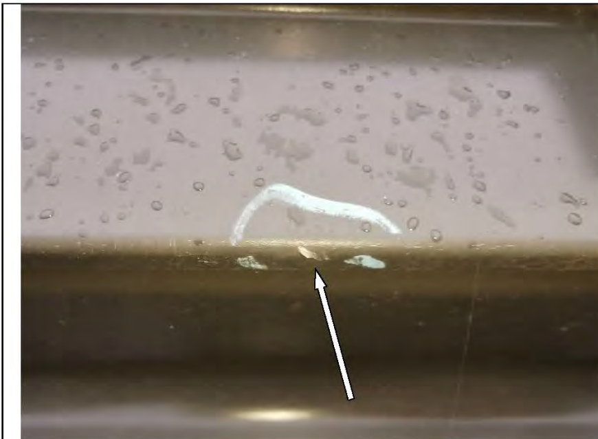
Фото №25. Царапины на профиле металлического оконного блока.
