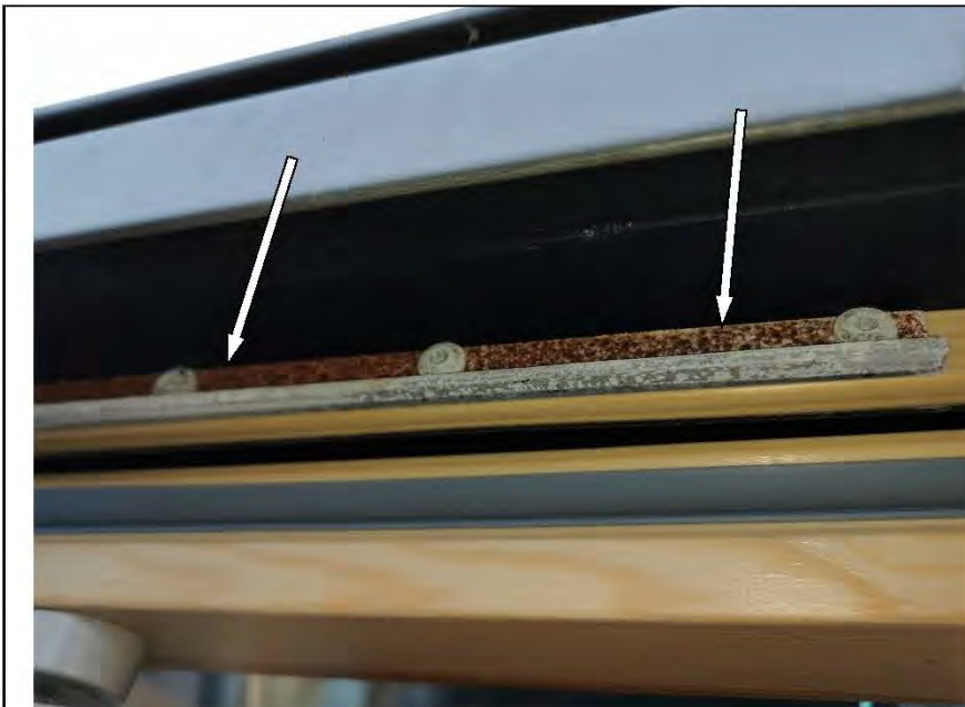
Фото №31. Коррозия на фурнитуре металлического оконного блока.
