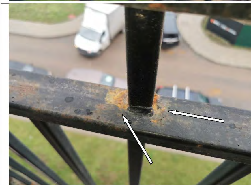
Фото №44. Коррозия на металлическом ограждении оконного блока.
