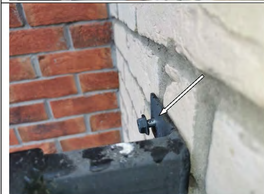
Фото №48. Царапины на металлическом профиле оконного блока в спальне.
