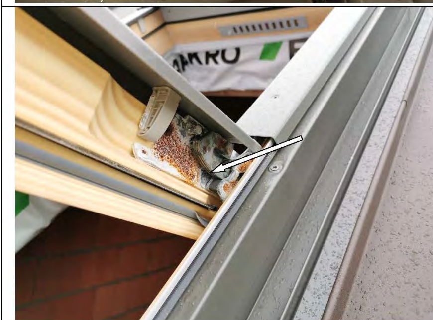
Фото №30. Коррозия на фурнитуре металлического оконного блока.
