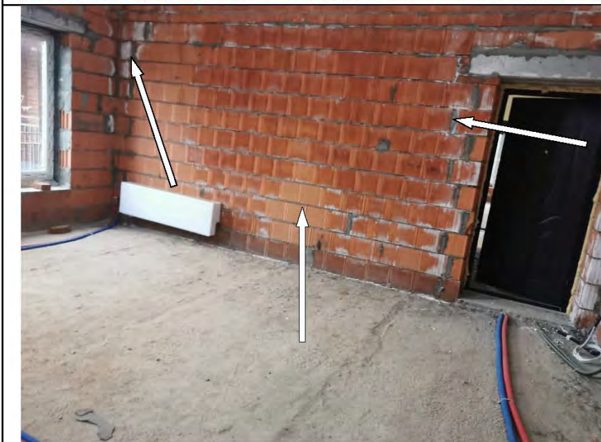
Фото №50. Следы заливки на стенах из кирпичной кладки.
