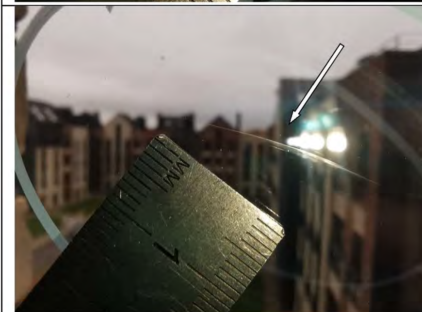
Фото №33. Царапины на стеклопакете оконного блока ПВХ.
