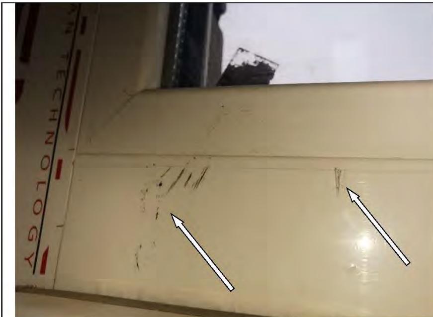
Фото №16. Царапины и потертости на профиле ПВХ оконного блока.
