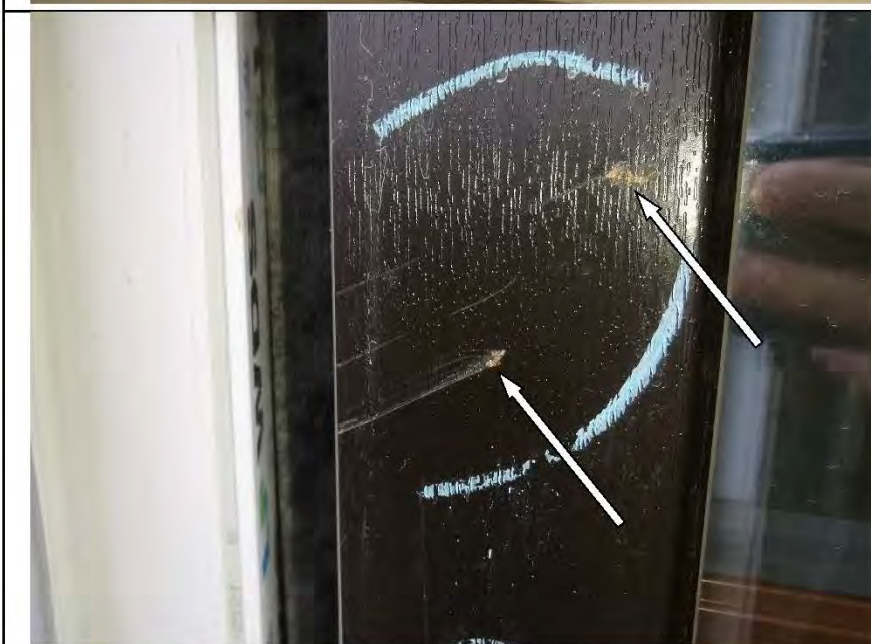
Фото №17. Царапины на профиле ПВХ оконного блока.
