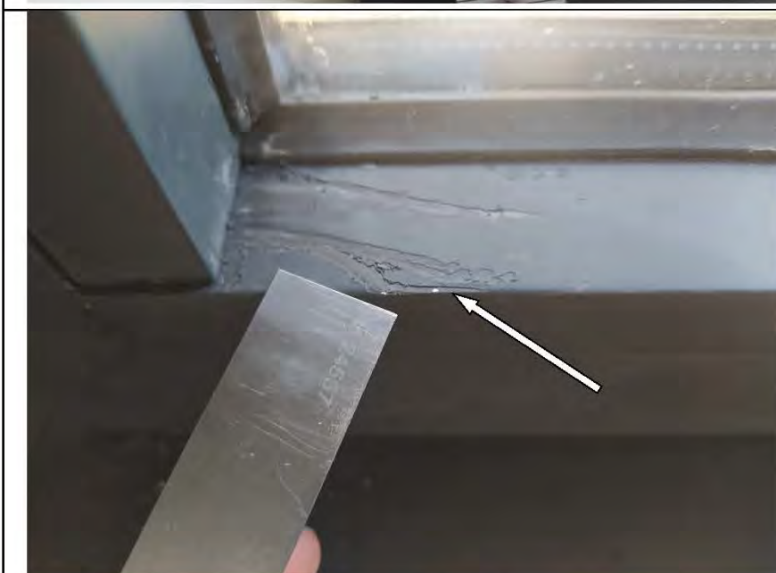
Фото №20. Дефект на металлическом профиле оконного блока на лоджии (сколы).
