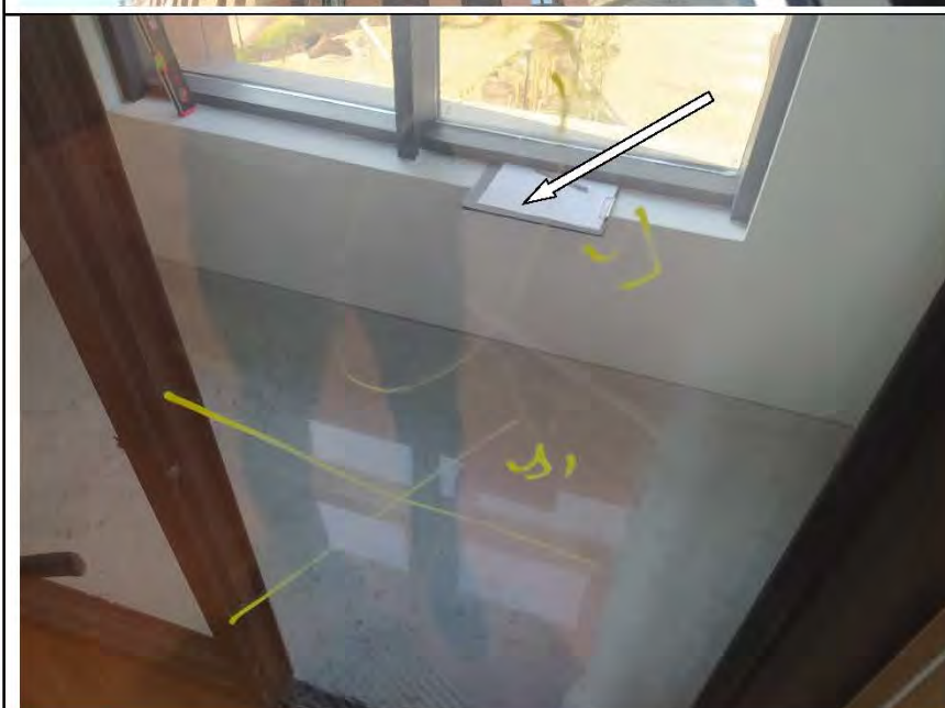
Фото №29. На стеклопакете дверного блока в спальне имеется дефект (царапины).
