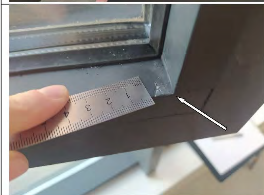
Фото №21. Дефект на металлическом профиле оконного блока на лоджии (сколы).
