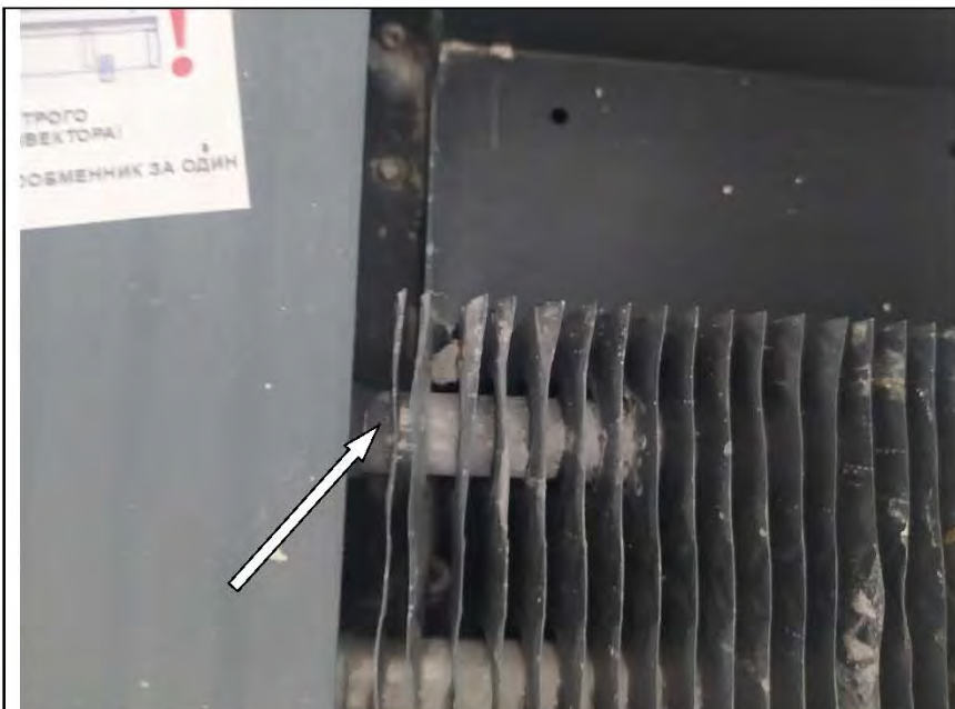
Фото №46. Радиатор №1 в кухне, имеет дефекты (замятия).
