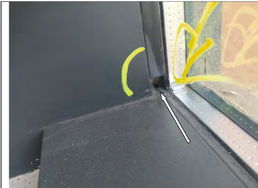
Фото №22. Дефект на металлическом профиле (зазор) оконного блока на лоджии.
