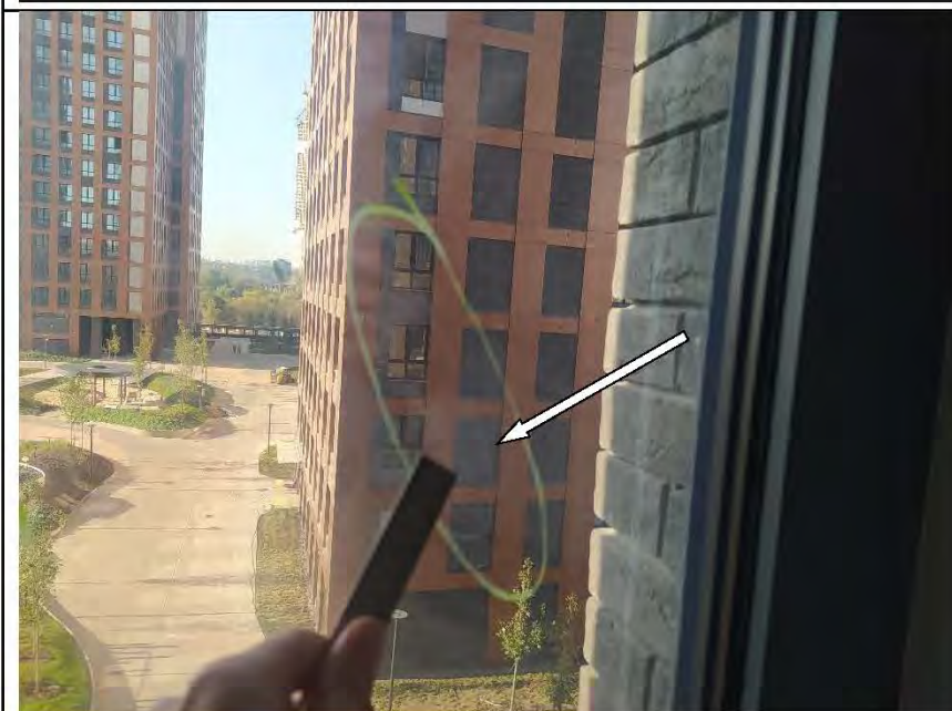
Фото №27. На стеклопакете оконного блока в кухне №2 имеется дефект (царапина).
