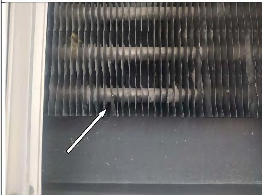
Фото №47. Радиатор №2 в кухне, имеет дефекты (замятия).
