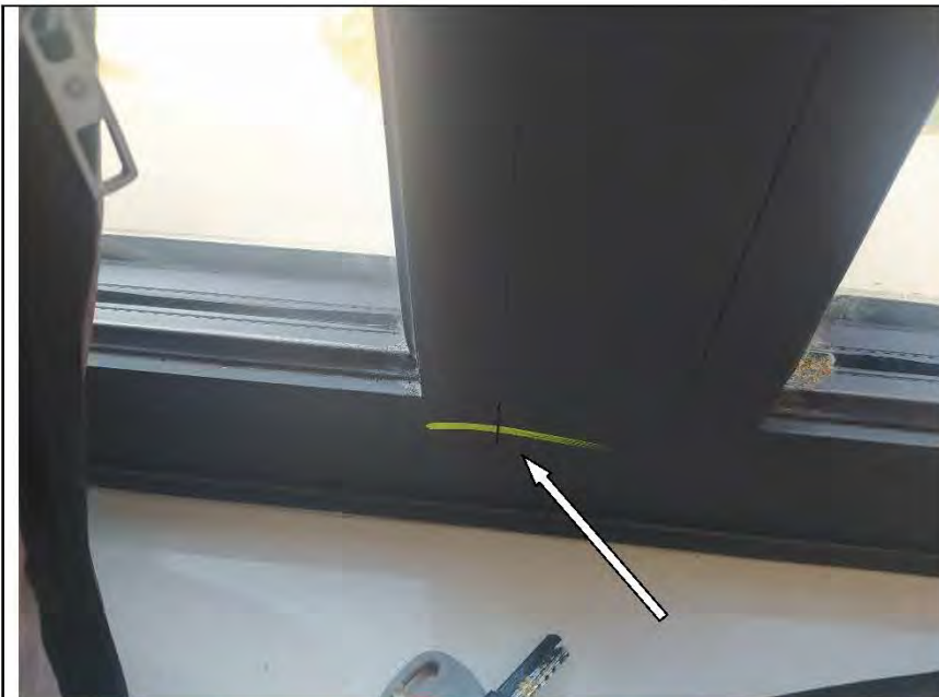
Фото №25. Дефект на металлическом профиле (зазор) оконного блока №2 в кухне.
