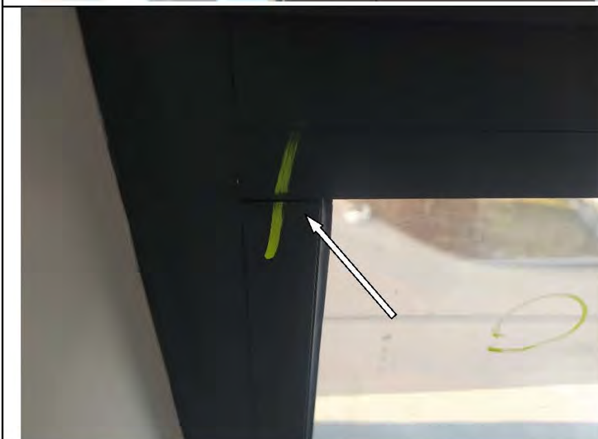
Фото №24. Дефект на металлическом профиле (зазор) оконного блока №1 в кухне.
