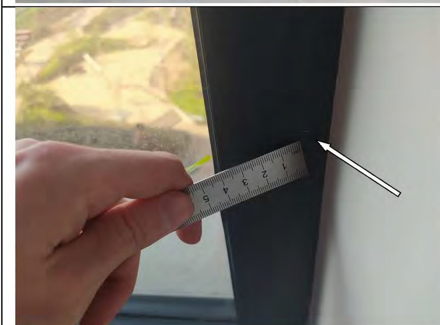
Фото №18. Дефект на металлическом профиле оконного блока №2 в кухне (царапина).
