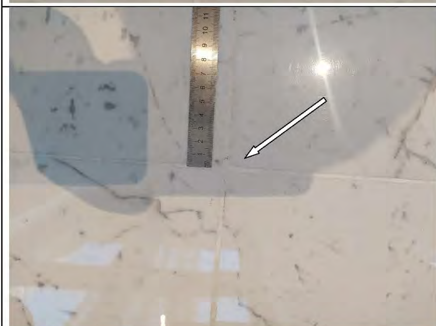
Фото №38. Затирка напольной плитки выполнена с нарушениями в кухне: разность ширины шва.
