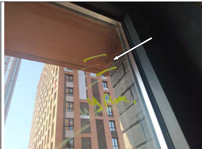
Фото №28. На стеклопакете оконного блока на лоджии имеется дефект (царапина).
