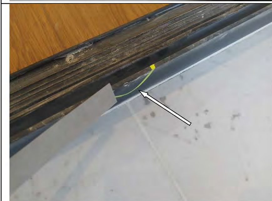
Фото №17. Дефект на металлическом профиле дверного блока в спальне (скол).
