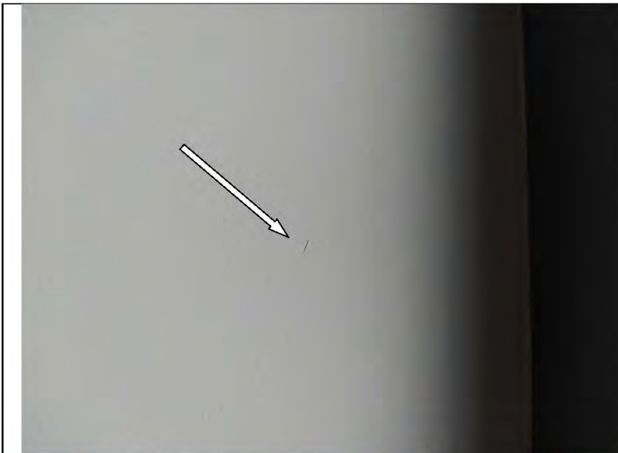
Фото №16. Окрашенные откосы оконного блока ПВХ №1 выполнены с дефектами (раковины)
