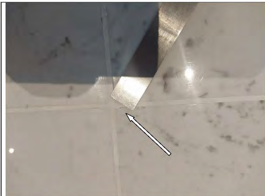
Фото №37. Напольная керамическая плитка в кухне имеет сколы.
