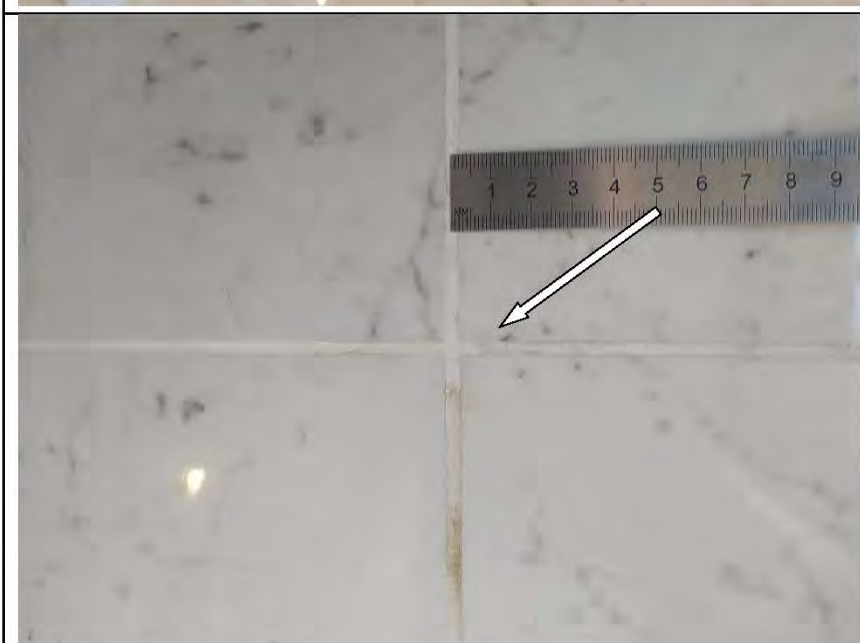
Фото №39. Затирка напольной плитки выполнена с нарушениями на лоджии: разность ширины шва.
